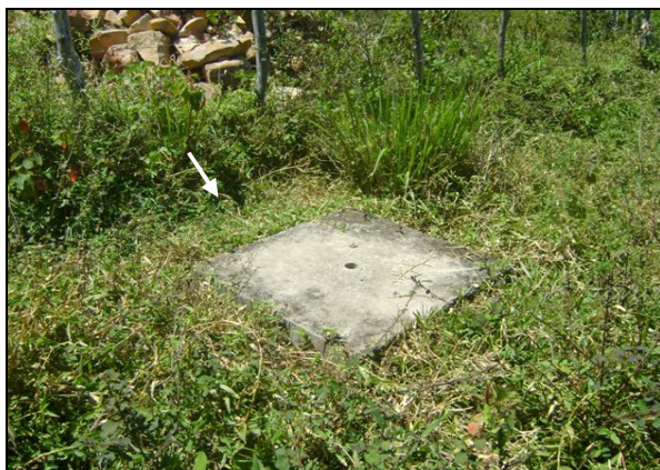
Foto 30 – Registro de descarga localizada na Rua Bairro Lagoinha.
