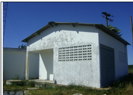
Foto 1 – EEAT-06: Sem identificação.
