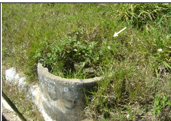
Foto 8 – Caixa de proteção da ventosa sem tampa.
