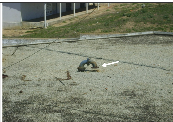
Foto 20 – RAP-13: Tubulação de ventilação sem tela de proteção.
