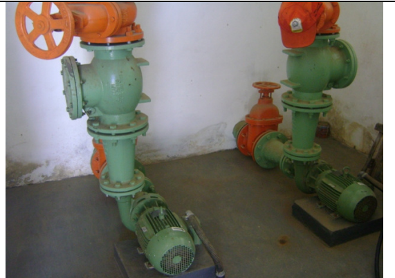
Foto 5 – EEAT-07: Conjunto moto-bomba.
