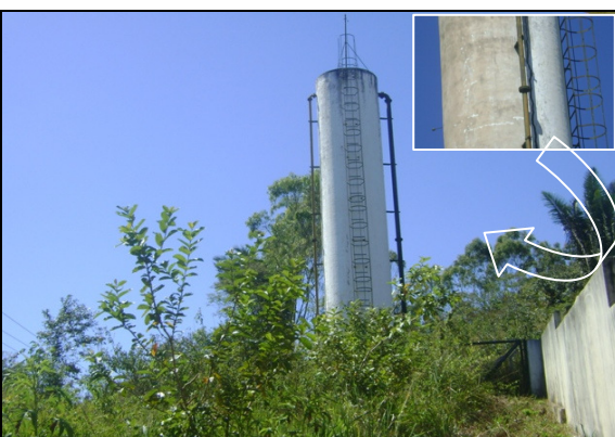
Foto 10 – Outra torre de equilíbrio desativada, devido a problema estrutural.
