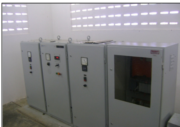
Foto 3 – EEAT-06: Quadro de comando do conjunto moto bomba.
