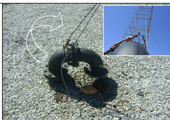
Foto 15 – RAP-12: Tubulação de ventilação sem tela de proteção e servindo para amarração de um andaime, utilizado como base improvisada de antena de rádio.
