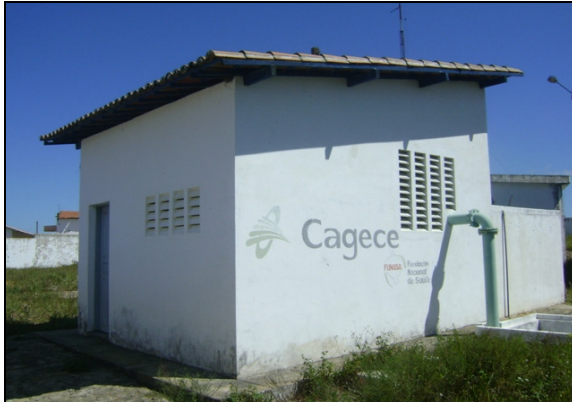
Foto 4 – EEAT-07: Sem identificação.
