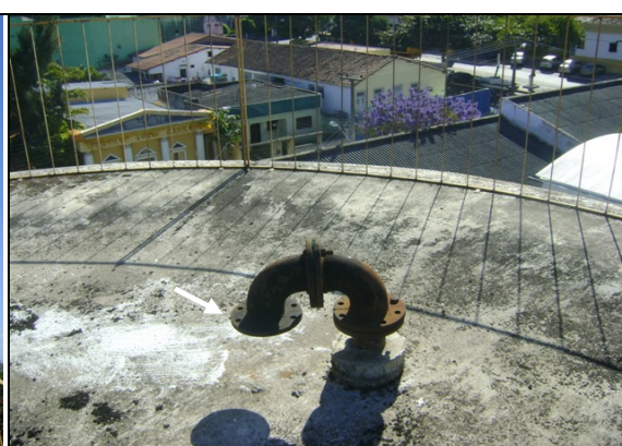
Foto 27 – REL-27: Tubulação de ventilação sem tela de proteção.
