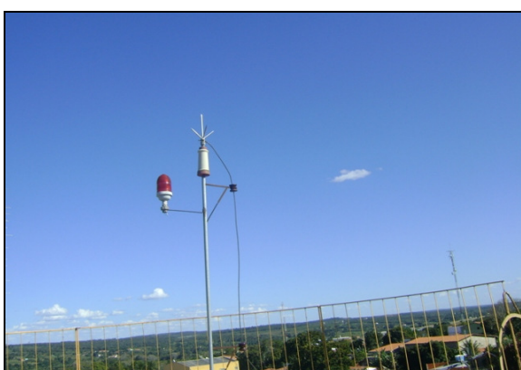
Foto 26 – REL-27: para-raio e sinalizador noturno.
