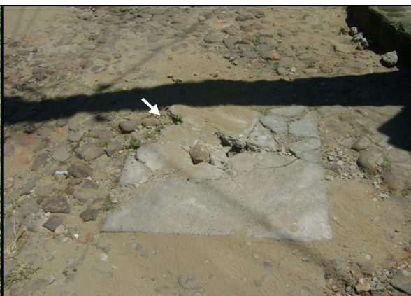
Foto 31 – Registro de descarga com tampa danificada, localizado na Rua Pe. Antônio José de Lima.
