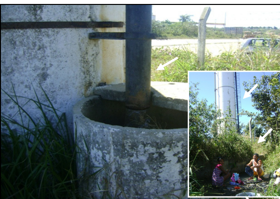
Foto 12 – Extravasamento contínuo da torre de equilíbrio. Presença de lavadeiras na saída da tubulação de descarga.
