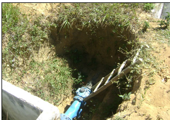
Foto 13 – Macromedidor localizado na entrada da EEAT-07, sem caixa de proteção.
