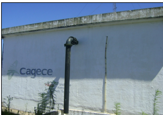
Foto 19 – RAP-13: Base improvisada de antena de rádio.
