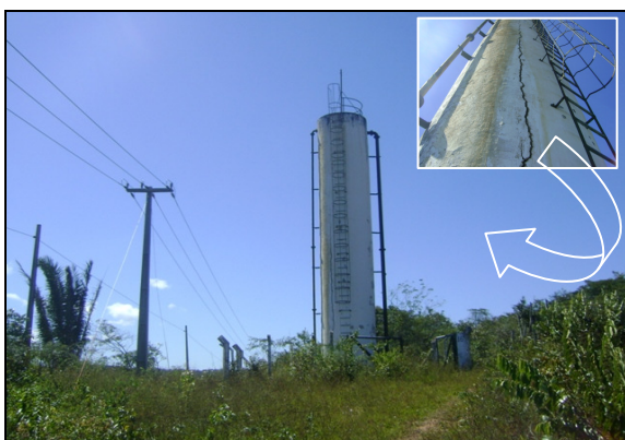
Foto 9 – Torre de equilíbrio desativada, devido a problema estrutural.
