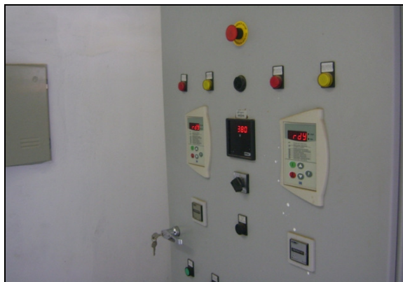
Foto 6 – EEAT-07: Quadro de comando do conjunto moto bomba.
