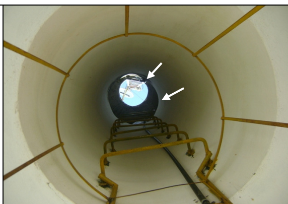
Foto 23 – REL-26: Ausência de tampa na laje superior e tela de proteção no acesso interno.
