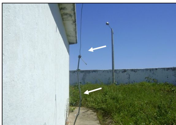
Foto 21 – RAP-13: Suporte da fiação do para-raios danificado.
