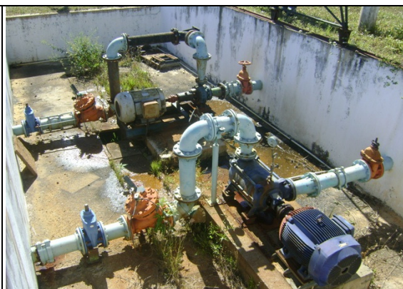
Foto 2 – EEAT-06: Conjunto moto-bomba.
