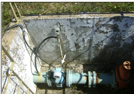
Foto 7 – Macromedidor localizado na saída da EEAT-06.
