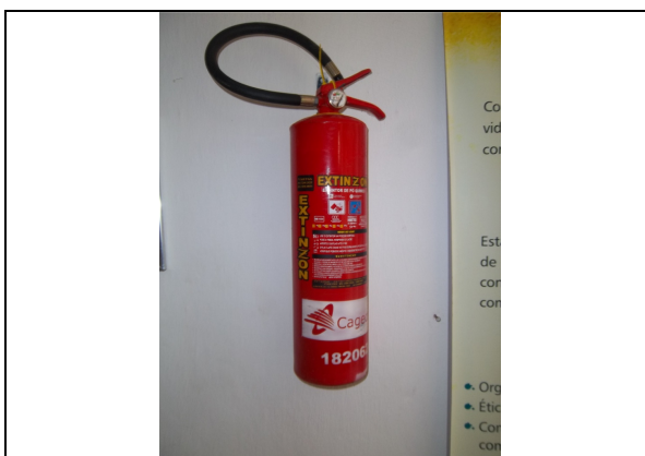
Foto 34 – Extintor de incêndio localizado no escritório do SAA de Coreaú.
