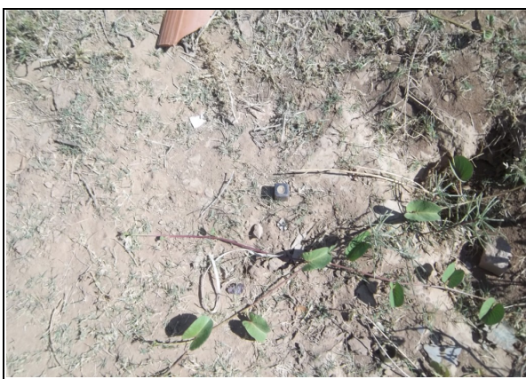
Foto 18 – Registro de descarga localizada na Rua Padre Joveliano Loyola, 15 (FNS) – Cemitério, sem caixa de proteção.
