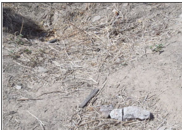
Foto 22 – Registro de manobra localizada na Rua Maria Machado, vizinho ao numero 1 (FNS) – Alto do Isaías, sem caixa de proteção.
