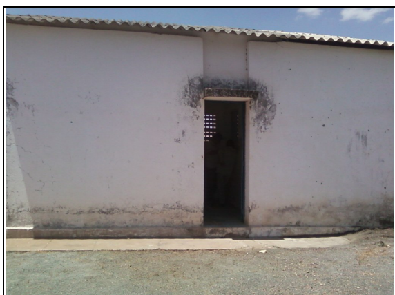
Foto 3 – EEAT-01: ausência de identificação.
