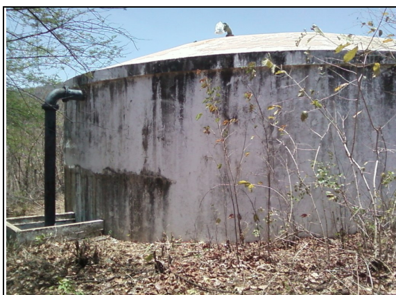
Foto 6 – RAP-02: ausência de identificação.
