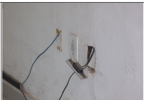
Foto 35 – Tomada de fiação elétrica sem fixação adequada.
