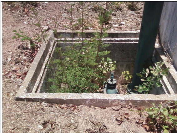
Foto 10 – RAP-02: ausência de tampa na caixa de proteção do registro.
