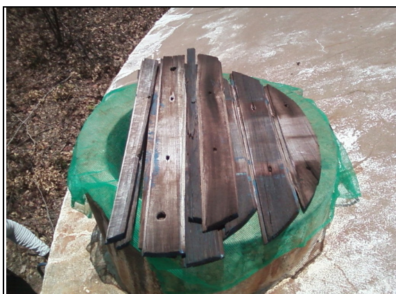
Foto 8 – RAP-02: tampa de inspeção inadequada.
