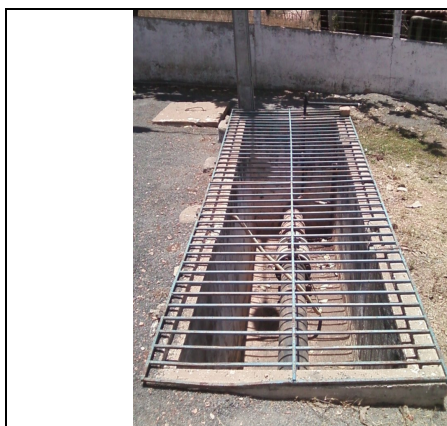
Foto 12 – AAT: macromedidor eletromagnético na saída da EEAT-01.
