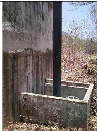
Foto 11 – RAP-02: ausência de tampa na caixa de proteção do registro.
