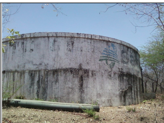
Foto 7 – RAP-02: pintura deteriorada.
