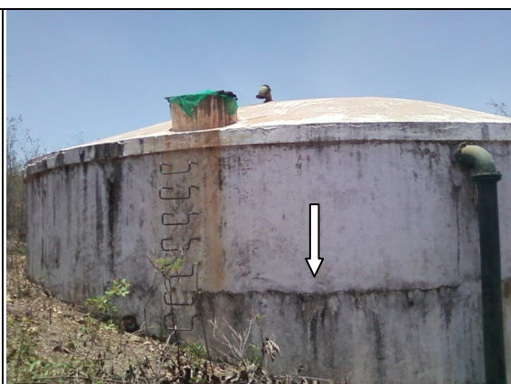
Foto 9 – RAP-02: vazamento na estrutura de concreto.
