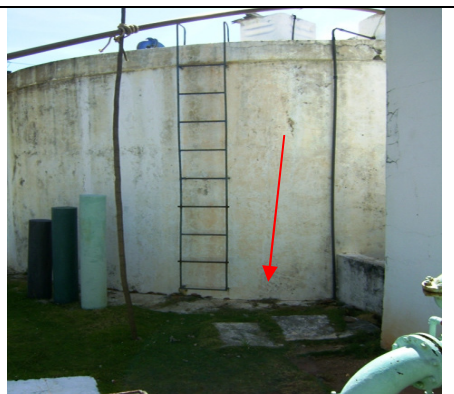
Foto 26 – RAP-01: rachaduras e sinais de vazamento
