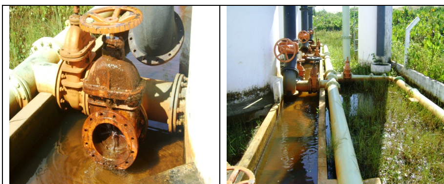
Foto 10 – Registro com vazamento
