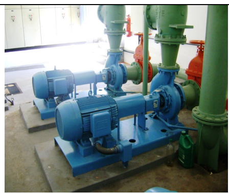
Foto 22 – Detalhe da EELF-01 – conjuntos motores-bomba
