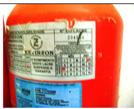
Foto 24 – Extintor de incêndio fora da validade
