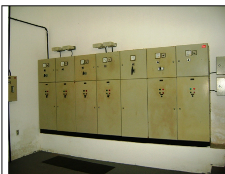
Foto 23 – Vista dos Quadros de comando das elevatórias EECS-01, EEAT-01 e EELF-01
