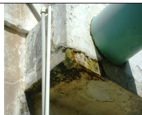
Foto 27 – RAP-01: vazamento na caixa de recepção.
