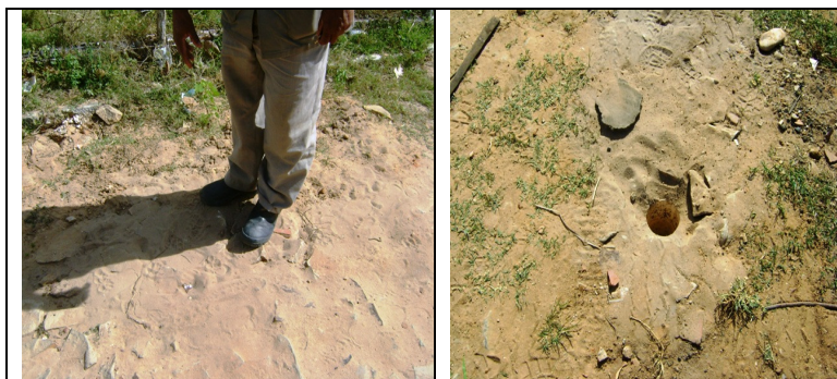
Fotos 36 e 37 – Registros de descarga na Trav. Frei Damiano e Rua Izaque da Rocha
