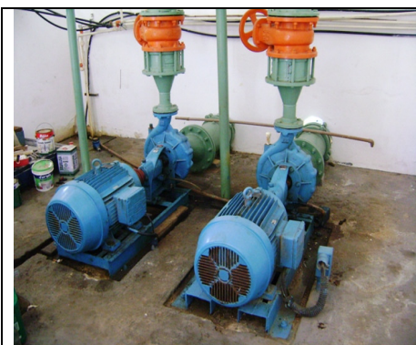
Foto 21 – Detalhe da EEAT-01 – conjuntos motores-bomba
