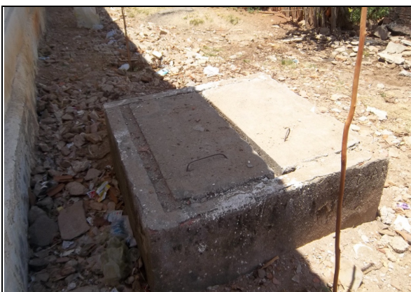
Foto 59 – Registro de descarga localizada na Rua Chico da Gentina, 208 (PMM) - Centro.
