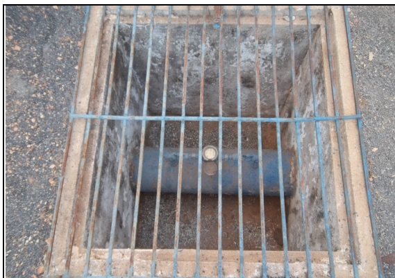
Foto 43 – Macromedidor proporcional na saída do REL-01, lavagem dos filtros.
