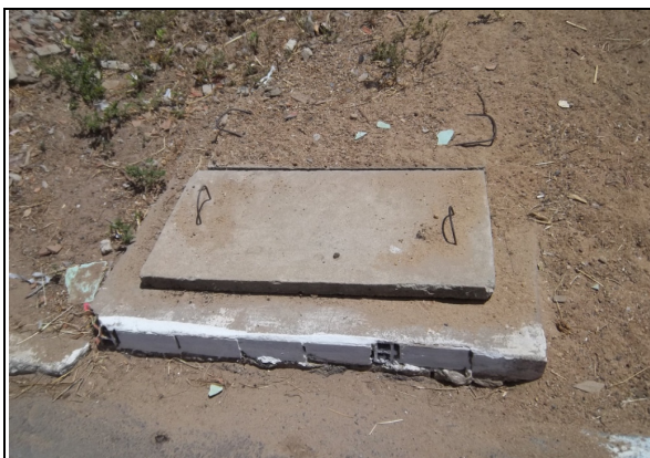
Foto 57 – Registro de descarga localizado na Rua 27 de Novembro paralela a Raimundo Gomes - Centro.
