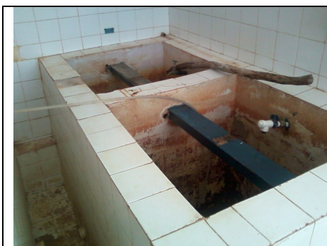
Foto 20 – Tanques dosadores sem agitadores.
