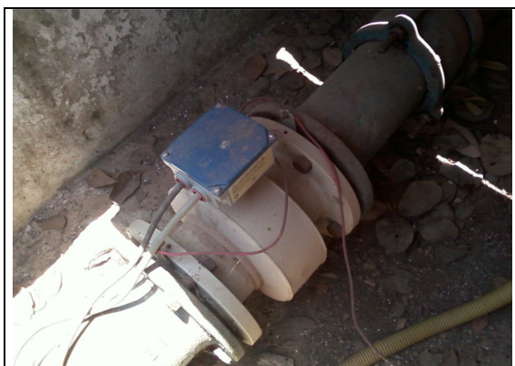
Foto 45 – Macromedidor eletromagnético na saída do RAP-01 para o REL-01.
