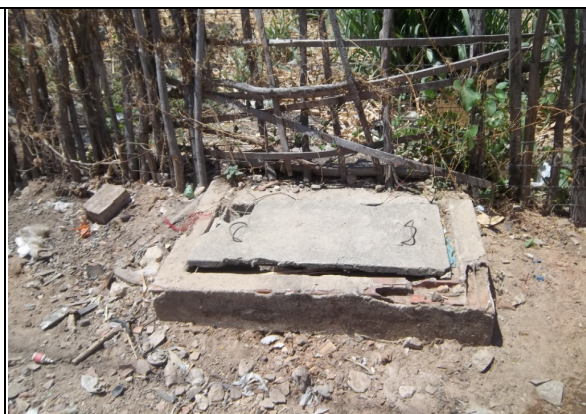
Foto 58 – Registro de descarga localizado na Rua Antonio Fernandes - Centro, com tampa e caixa de proteção, danificada.
