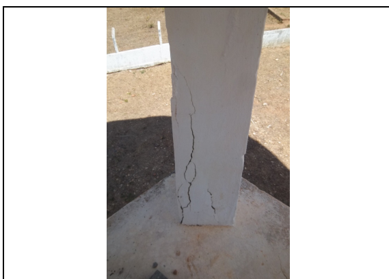
Foto 32 – REL-02: fissuras na coluna.
