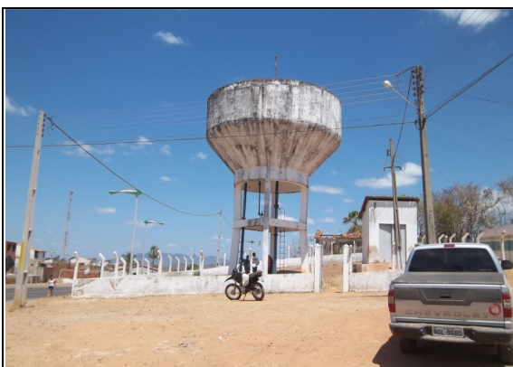
Foto 34 – REL-02: pintura deteriorada.
