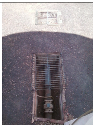
Foto 44 – Macromedidor eletromagnético na saída do REL-01, com grade de proteção incompleta.
