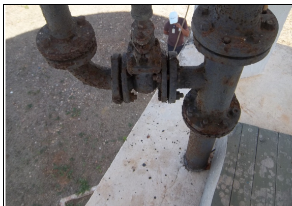
Foto 40 – REL-02: barrilete deteriorado.
