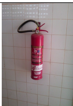
Foto 21 – Extintor de incêndio na casa de química.
