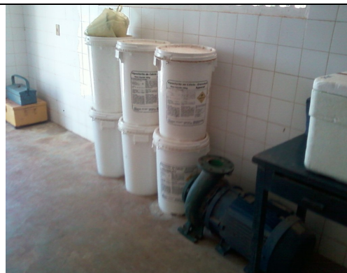
Foto 2 – Captação: conjunto motor-bomba reserva na casa de química.
