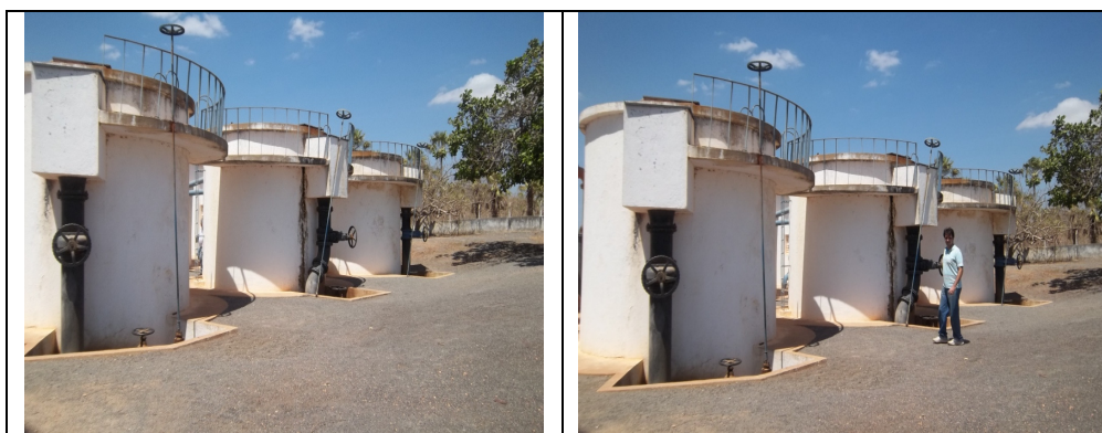
Foto 9 – Filtros 1, 2 e 3: ausência de identificação.
