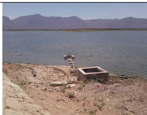
Foto 4 – Captação: caixa da válvula de retenção sem tampa de proteção.
