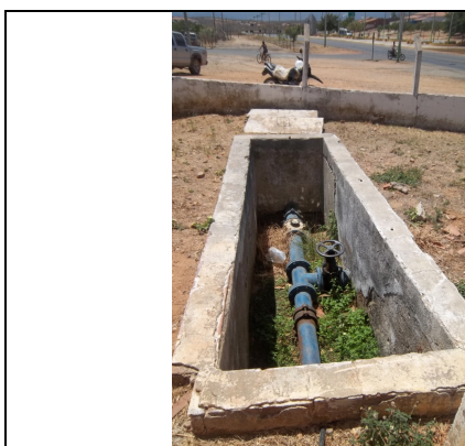
Foto 47 – Macromedidor woltman na chegada do REL-02, com caixa sem grade de proteção.
