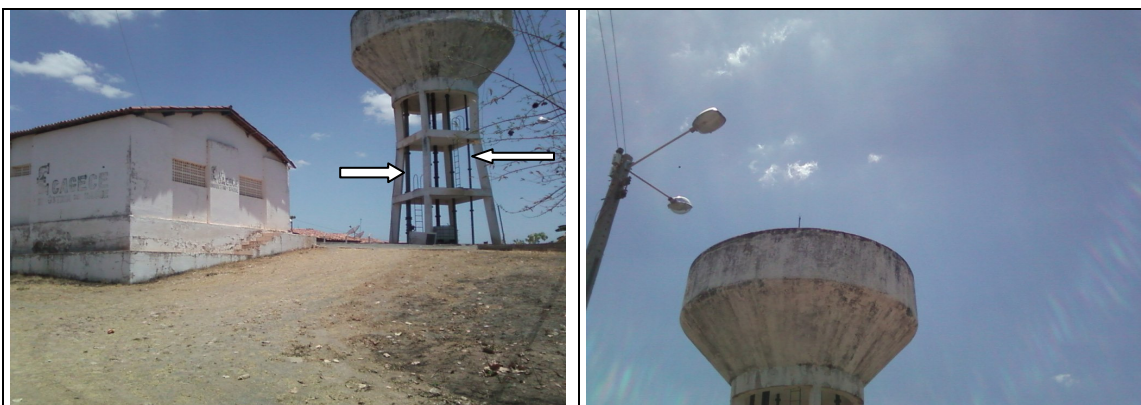
Foto 32 – REL-01: escada externa sem fixação adequada no 1º vão.
