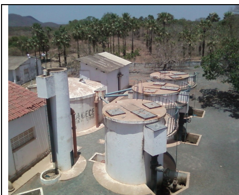
Foto 5 – ETA: vista geral dos filtros.
