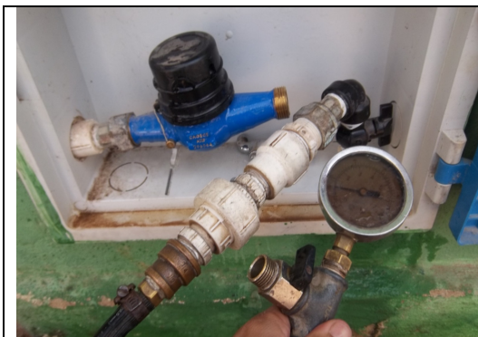
Foto 64 – RDA: medição de pressão no endereço Rua Raimundo Gomes, 54 (FNS).
