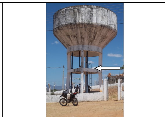
Foto 35 – REL-02: ausência de gaiola protetora na escada de acesso externo.
