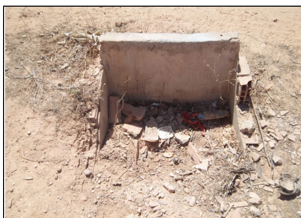
Foto 61 – Registro de manobra localizada na entrada da Vila.
