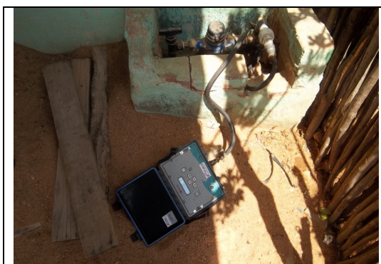
Foto 66 – RDA: medição de pressão no endereço Rua SDO 03, 21 (FNS).
