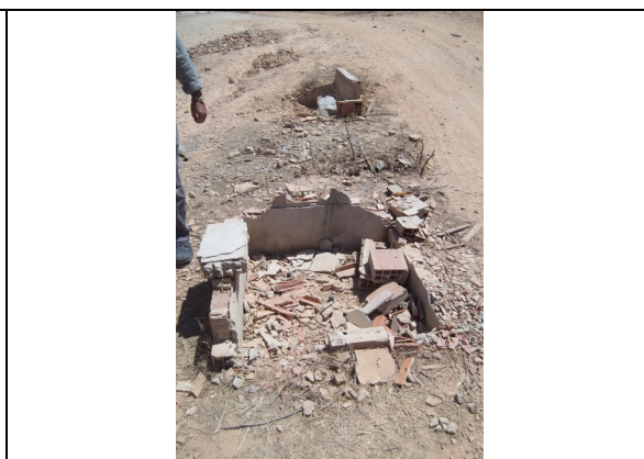
Foto 60 – Registro de manobra localizada na Estrada Várzea da Volta.
