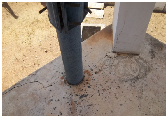
Foto 37 – REL-02: fissuras na laje do 1º patamar.
