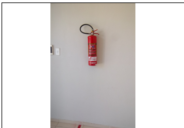
Foto 71 – Extintor de incêndio do escritório/atendimento do SAA de Moraujo, dentro do prazo de validade.
