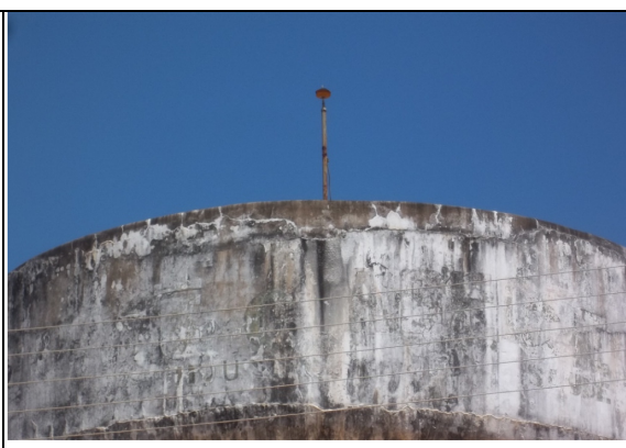
Foto 39 – REL-02: ausência de sinalização noturna.
