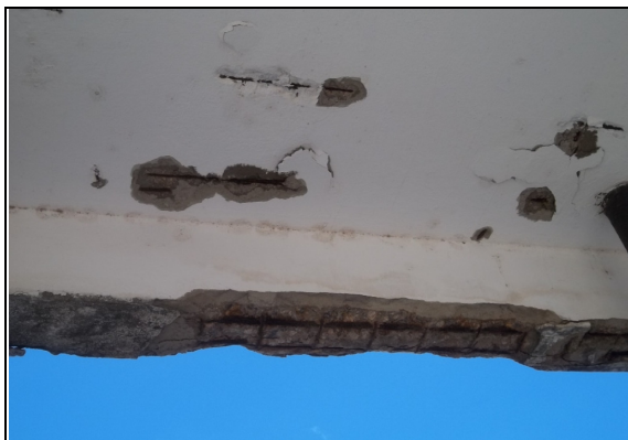
Foto 36 – REL-02: armadura exposta em viga.
