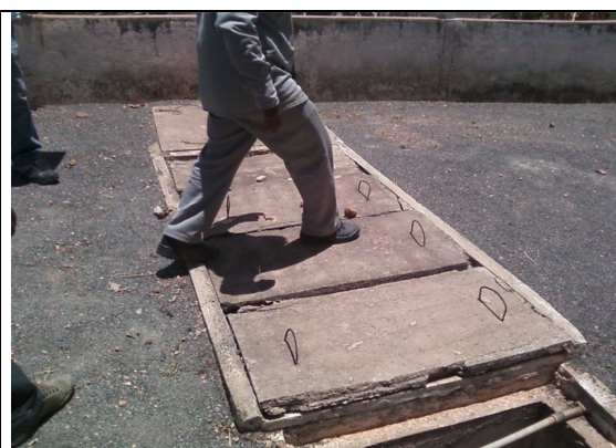
Foto 48 – Caixas de proteção de acessórios, com tampas quebradas.
