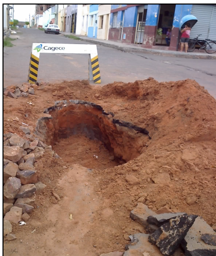
Foto 13 – Vazamento na rede de distribuição à Rua São Mamede esquina com a Rua José de Alencar.
