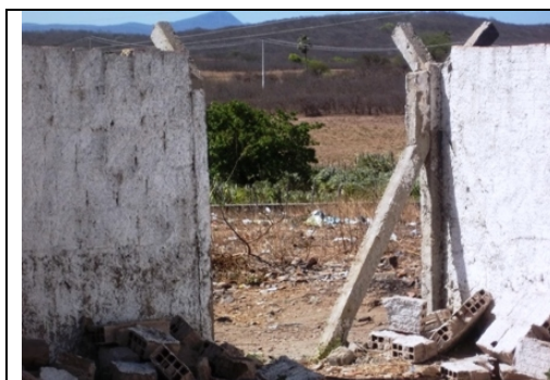
Foto 56 – Muro quebrado na área dos reservatórios
