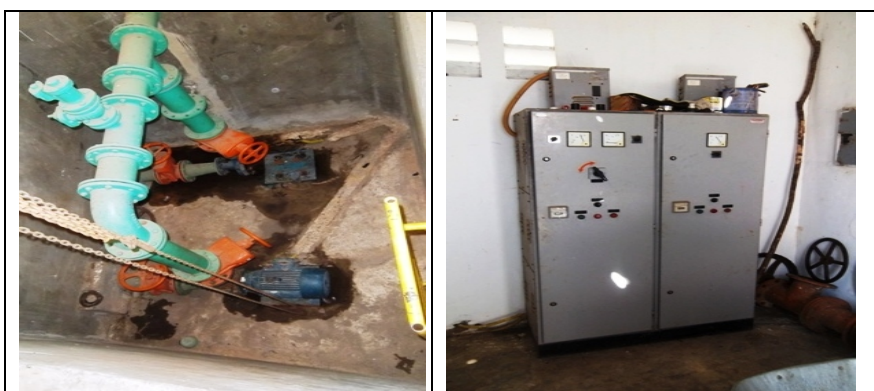
Fotos 30 e 31 – EEAT-03 - conjuntos motores-bomba e quadros de comando
