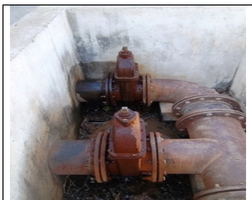
Foto 48 – RAP-04 – vazamentos nos registros
