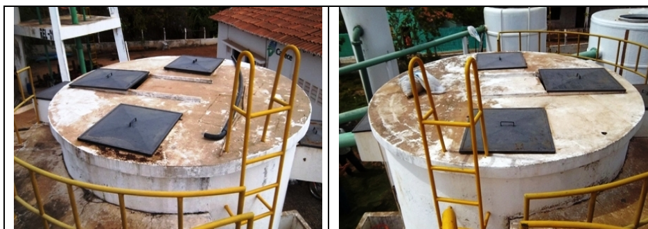
Fotos 9 e 10 – Vistas superiores dos filtros F-1 e F-2
