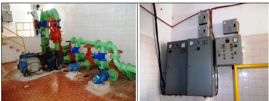
Fotos 27 e 28 – EEAT-01 e EEAT-02 – conjuntos motores-bomba e quadros de comando
