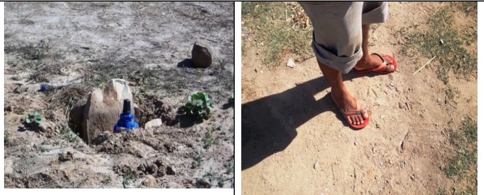
Fotos 66 e 67 – Registros de descarga na Estrada para Ipaguassu e Marambaia
