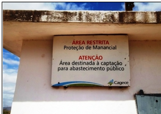
Foto 3 – Placa de sinalização
