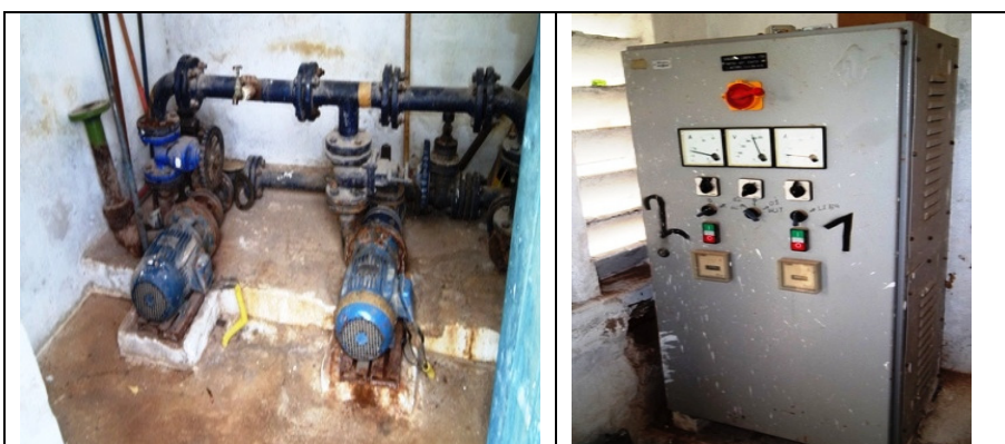
Fotos 30 e 31 – Booster – conjuntos motores-bomba e quadro de comando
