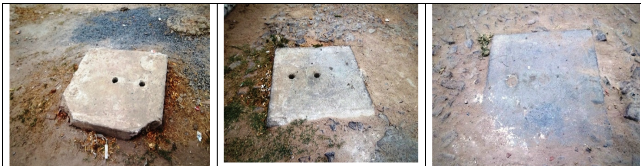
Fotos 46, 47 e 48 – Registros de descarga nas Ruas Padre Francisco Aragão, Francisco das Chagas Costa e Trav, Manoel Teixeira de Araujo.
