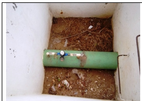
Foto 41 – Medidor proporcional na saída do RAP-01.
