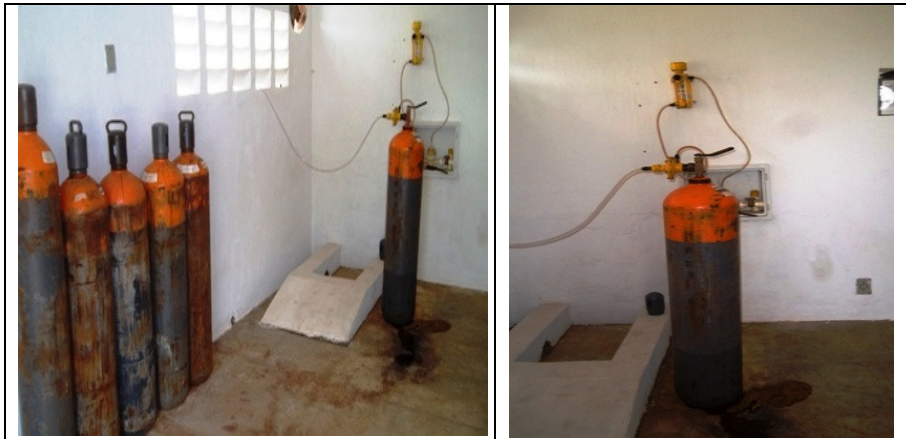
Fotos 18 e 19 – Cilindros de cloro
