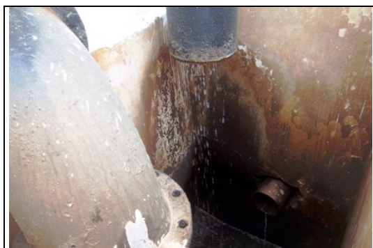
Foto 17 – Registro com vazamento
