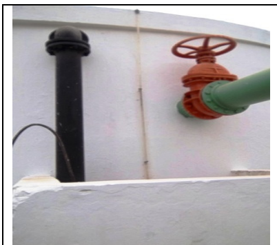
Foto 40 – Medição de nível do RAP-01
