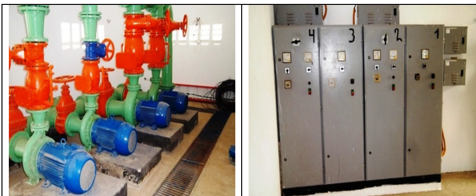
Fotos 28 e 29 – EEAT-01 e EELF-01 – conjuntos motores-bomba e quadros de comando
