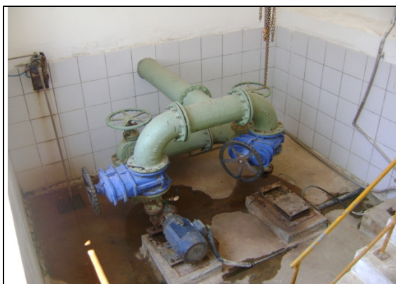
Foto 31 – EEAT-01: Conjunto moto-bomba
