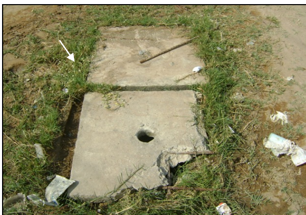
Foto 49 – Registro de descarga localizado na Rua Vila Nova, apresentando tampa danificada.
