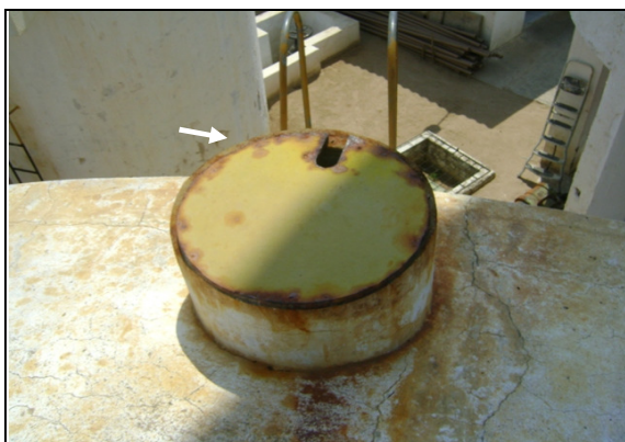
Foto 38 – RAP-01: Tapa de inspeção oxidada
