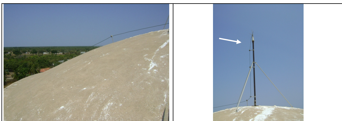
Foto 45 – REL-01: Sem tubulação de ventilação.
