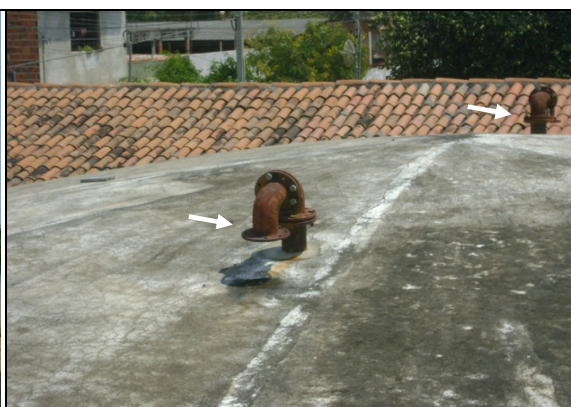
Foto 42 – RAP-02: Sem tela de proteção na tubulação de ventilação.
