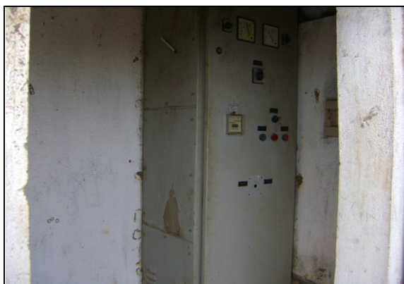
Foto 27 – EECS-01: Quadro de comando.
