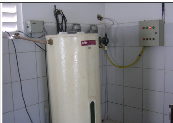
Foto 20 – Dosador de flúor.
