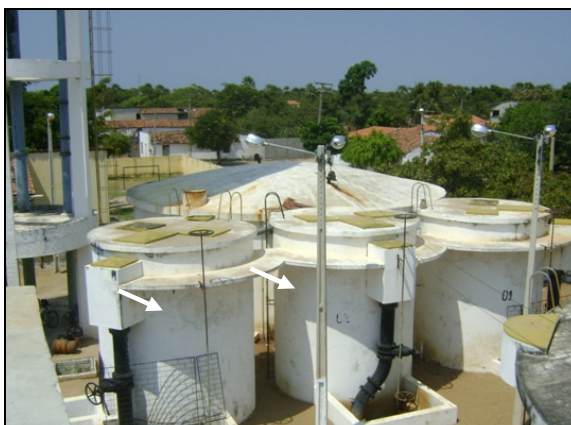
Foto 6 – Filtros 02 e 03: Sem identificação.
