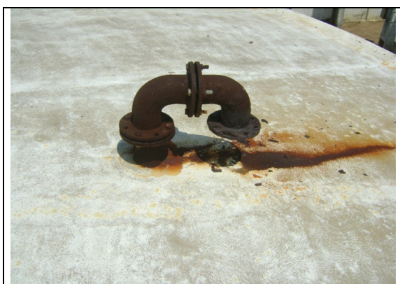
Foto 40 – RAP-01: Sem tela de proteção na tubulação de ventilação.
