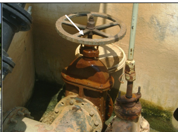
Foto 7 – Filtro 02: Registro de lavagem apresentando vazamento.
