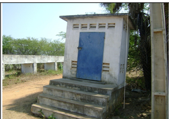
Foto 28 – EECS-01: Casa do quadro de comando - inclinada.
