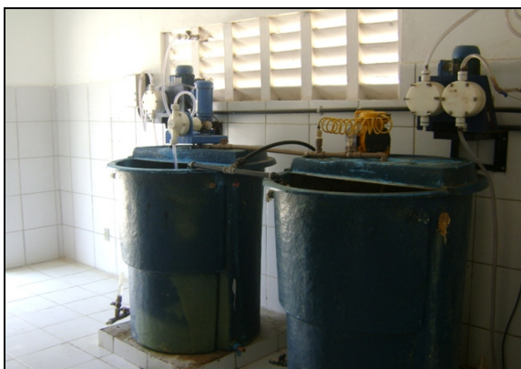
Foto 21 – Tanques de mistura.
