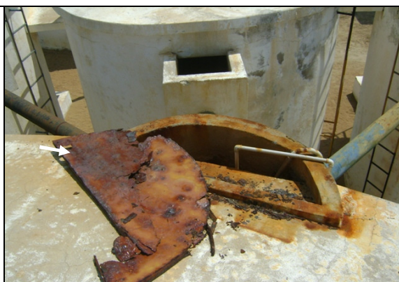
Foto 39 – RAP-01: Tapa da calha de entrada comprometida pela corrosão
