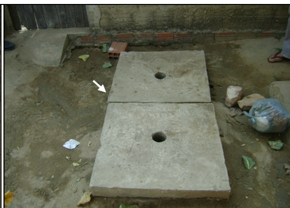
Foto 52 – Registro de descarga localizado na Rua 5, COHAB.
