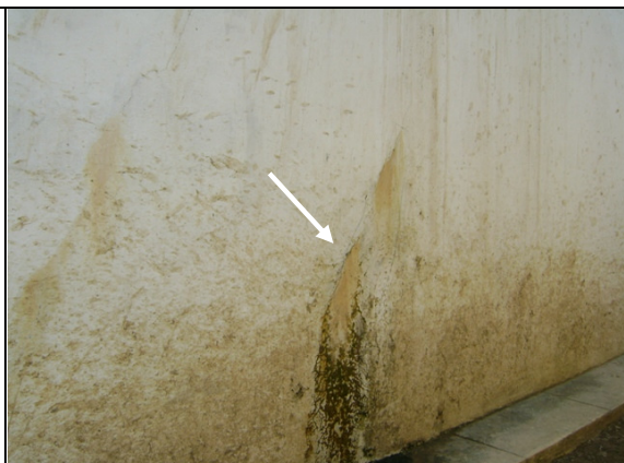
Foto 5 – Floco-decantador: Estrutura apresentando vazamento.
