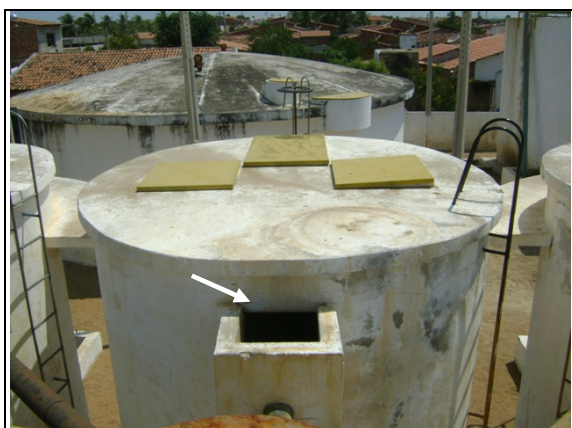
Fotos 8 – ETA: Filtro 02: Caixa de saída de água tratada sem tampa.
