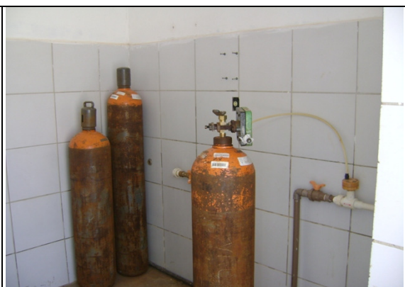
Foto 22 – Dosador de cloro gasoso.
