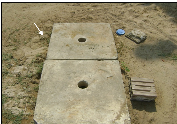
Foto 51 – Registro de descarga localizado na Rua Antônio Soares da Silva.
