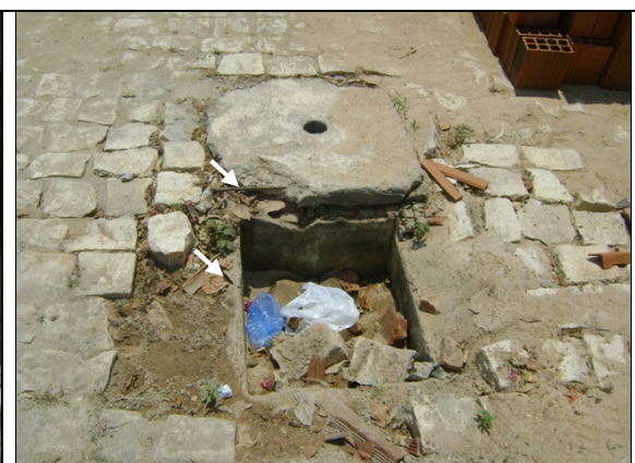
Foto 54 – Registro de descarga localizado na Rua Coronel Antônio José de Freitas, apresentando caixa do registro danificada e caixa da descarga sem tampa.
