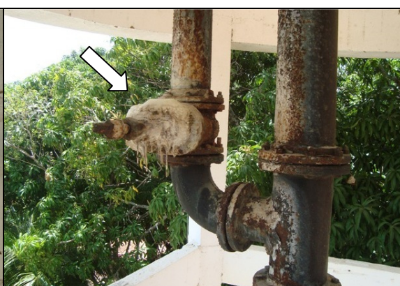
Foto 37 – Incrustação no registro do REL-01.
