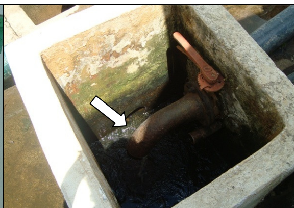
Foto 5 – Vazamento no registro do filtro 3.
