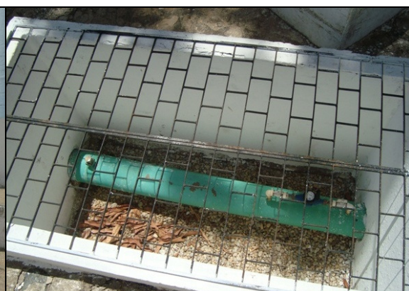
Foto 39 – Medidor proporcional na entrada do REL-01.
