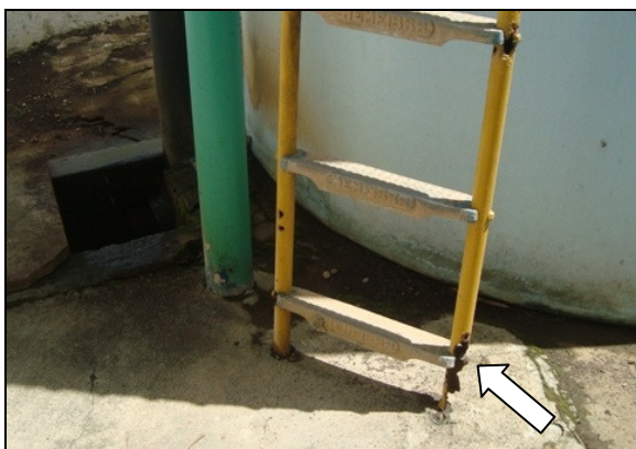
Foto 7 – Escada do filtro 2 oxidada.
