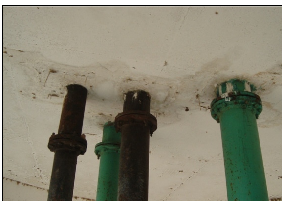
Foto 36 – Infiltração na laje de fundo do REL-01.
