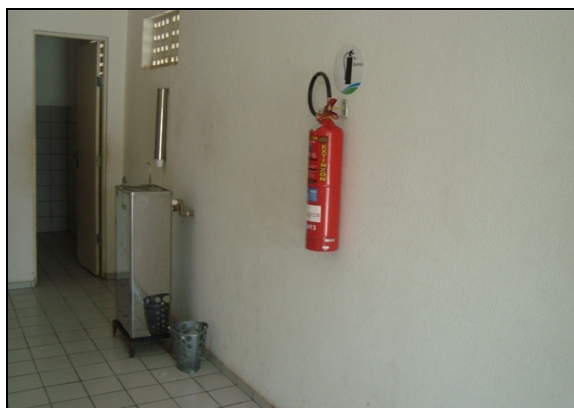
Foto 46 – Extintor de incêndio do escritório.
