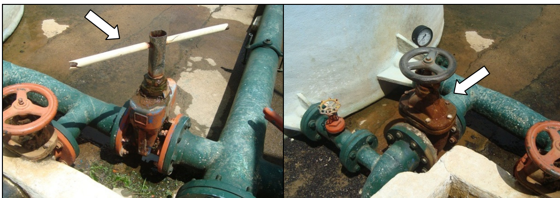
Foto 2 – Registro do filtro 1 quebrado e com vazamento.
