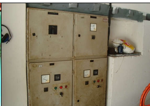
Foto 26 – Quadro de comando da EEAT-01.
