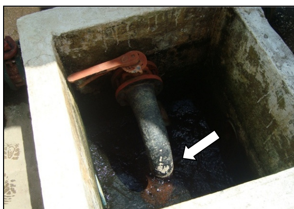
Foto 6 – Vazamento no registro do filtro 4.
