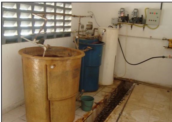
Foto 13 – Dosadores de PAC e de flúor.
