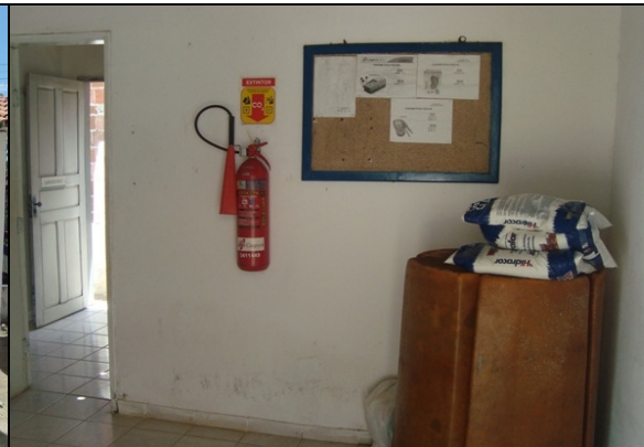
Foto 12 – Extintor de incêndio da casa de química.
