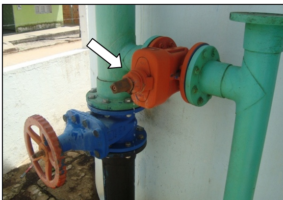
Foto 4 – Vazamento no registro do filtro 2.
