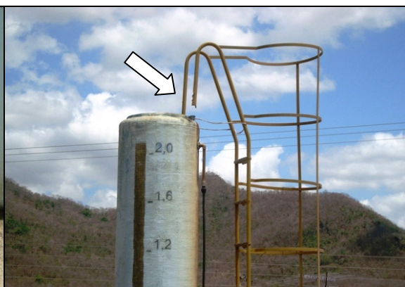
Foto 8 – Escada da torre de equilíbrio oxidada.
