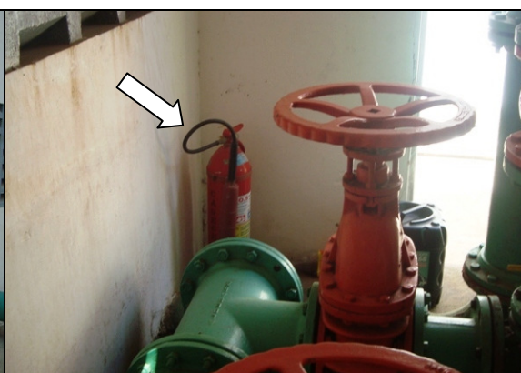
Foto 28 – Extintor de incêndio da EEAT-01.
