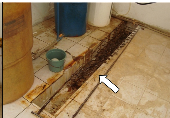
Foto 14 – Grelha do piso oxidada.
