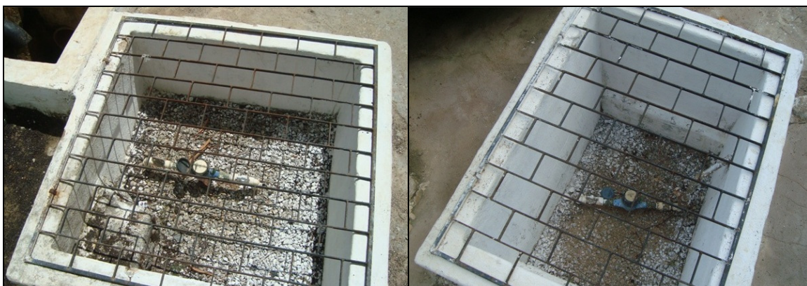
Fotos 9 e 10 – Medidores proporcionais instalados na entrada dos filtros.
