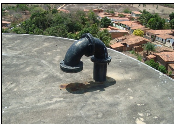
Fotos 34 e 35 – Ventilações do REL-01.
