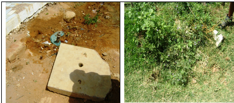
Fotos 59 e 60 – Registros de descarga na Rua Fco. Pereira Lima e Av. Brasília
