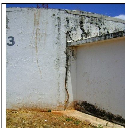
Foto 48 – RAP-03: medidor de nível danificado
