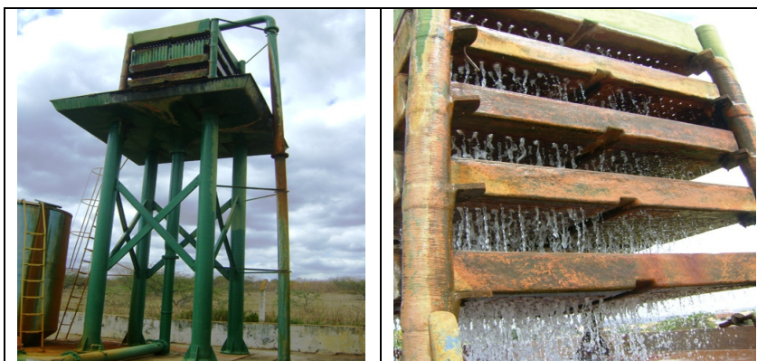
Fotos 15 e 16 – Vistas do aerador
