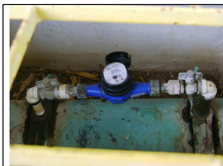
Foto 51 – Medidor proporcional na saída da ETA
