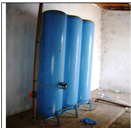
Foto 36 – Sistema de pressurização
