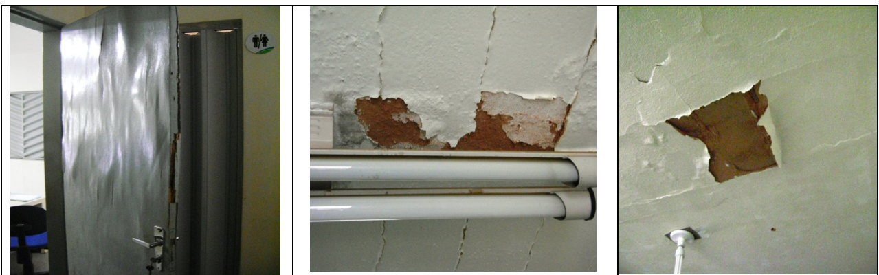
Fotos 64, 65 e 66 – Porta danificada e pintura deteriorada
