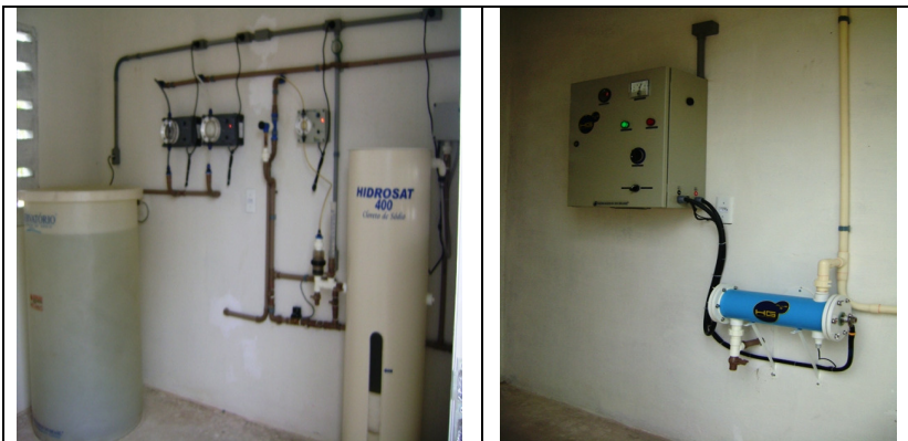
Fotos 21 e 22 – Vistas da Fábrica de cloro
