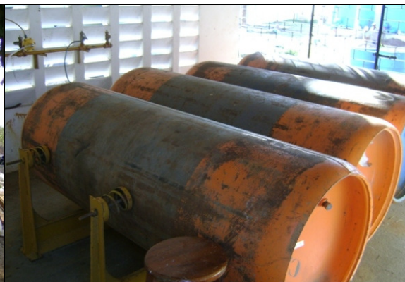
Foto 30 – Cilindros de cloro gasoso.
