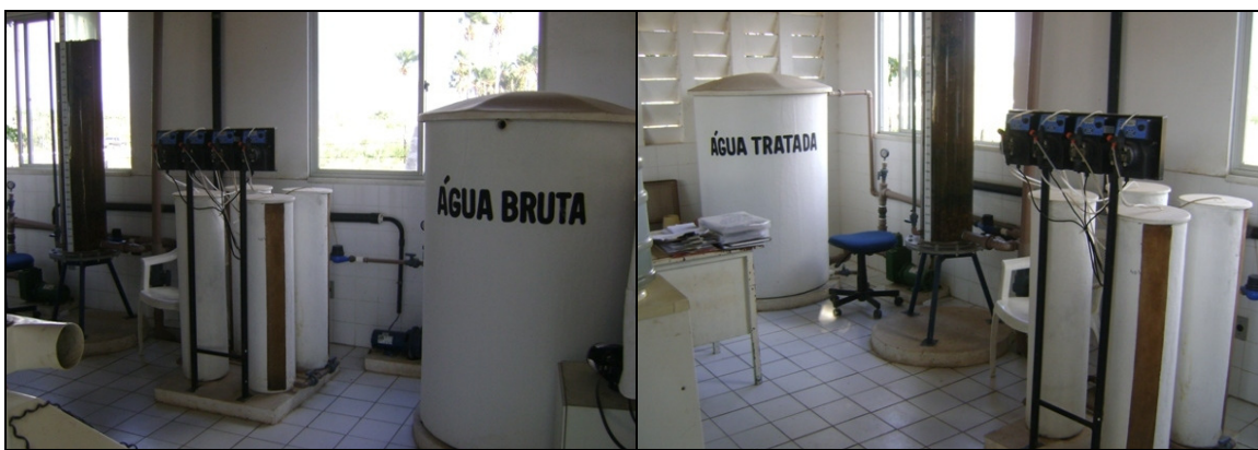
Fotos 34 e 35 – Vistas internas da ETA Piloto.
