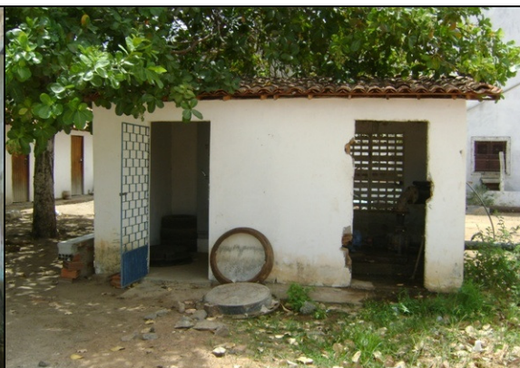
Foto 61 – Casa de comando da elevatória EERD-02.
