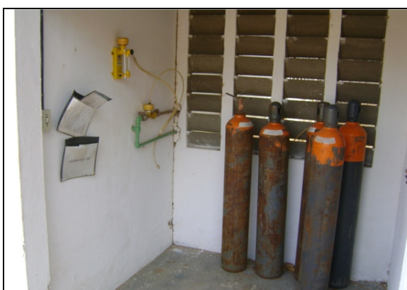
Foto 11 – Cilindros de cloro gasoso.
