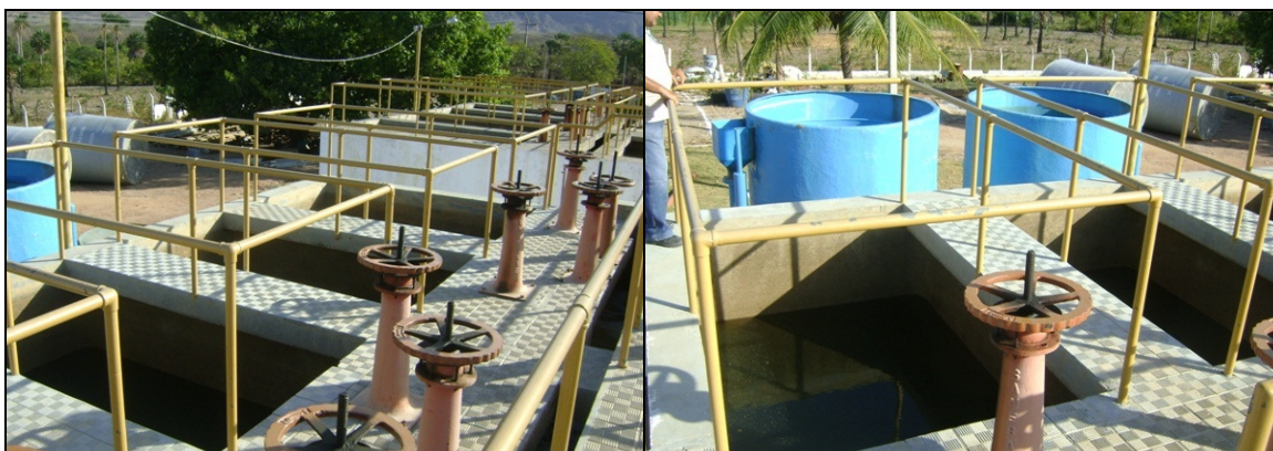
Fotos 21 e 22 – Vistas dos Filtros.
