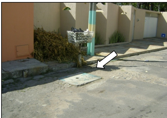
Foto 84 – Registro de descarga na Rua João Araújo Teixeira, Fazendinha.
