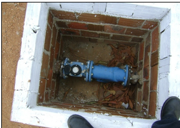
Foto 79 – Macromedidor na saída da ETA-01.
