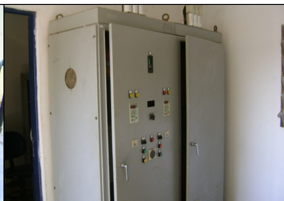
Foto 43 – Quadro de comando da EEPR-01.
