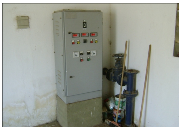
Foto 59 – Quadro de comando da EERD-01.
