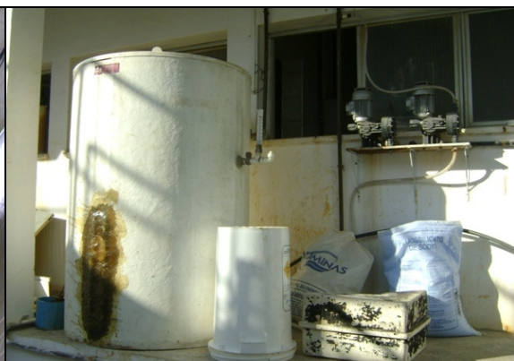
Foto 27 – Dosadores de flúor.
