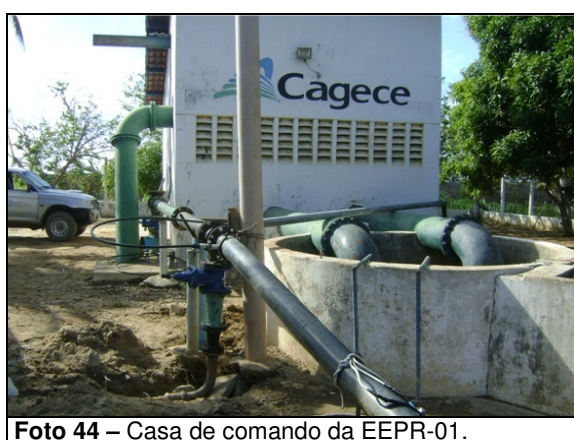
Foto 44 – Casa de comando da EEPR-01.
