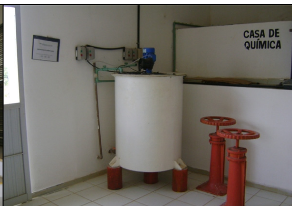
Foto 10 – Dosadores de flúor.
