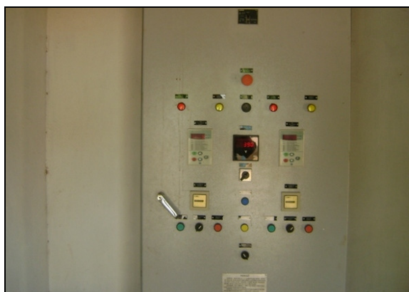
Foto 62 – Quadro de comando da EERD-02.
