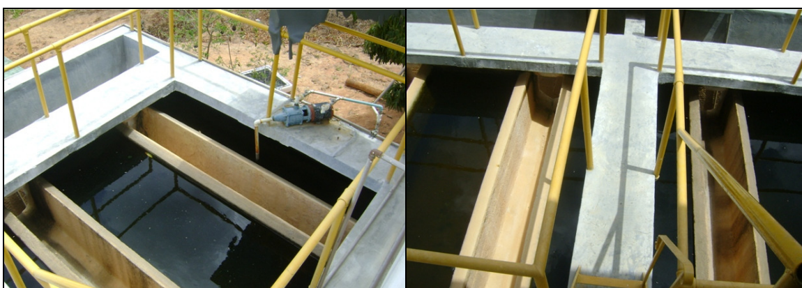
Fotos 7 e 8 – Vistas dos Filtros.
