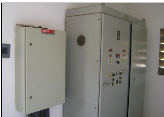
Foto 47 – Quadro de comando das elevatórias EEAB-01 e EEAT-03.
