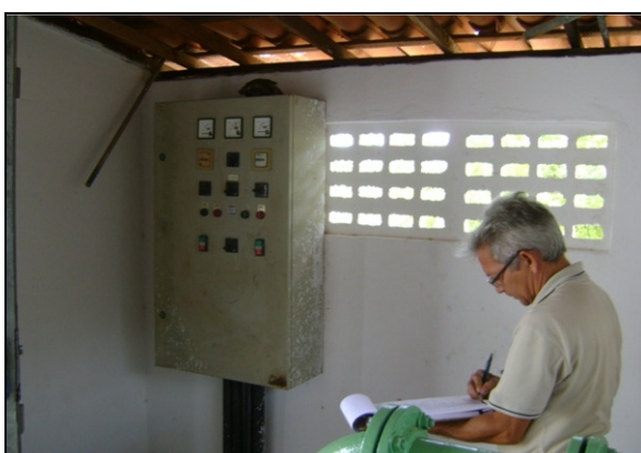
Foto 55 – Quadro de comando da elevatória EEAT-02.
