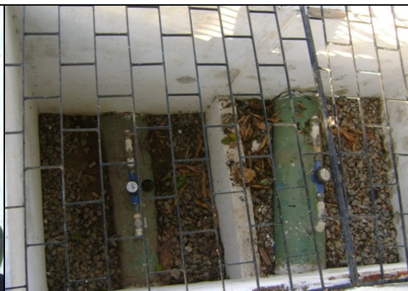
Foto 80 – Medidores proporcionais na saída da ETA-02.
