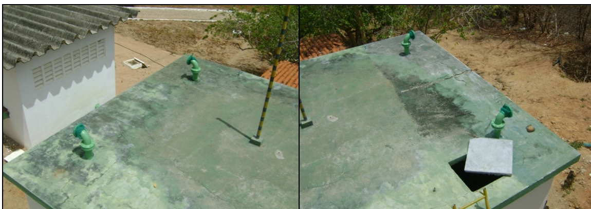
Fotos 74 e 75 – Ventilações do RAP-01.
