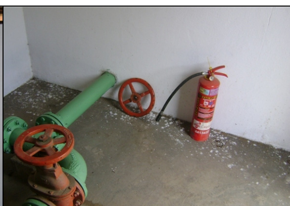
Foto 56 – Extintor de incêndio da elevatória EEAT-02.
