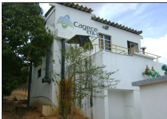
Foto 6 –Filtros da ETA-01.
