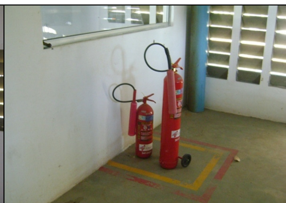
Foto 48 – Extintores de incêndio da casa de comando das elevatórias EEAB-01 e EEAT-03.
