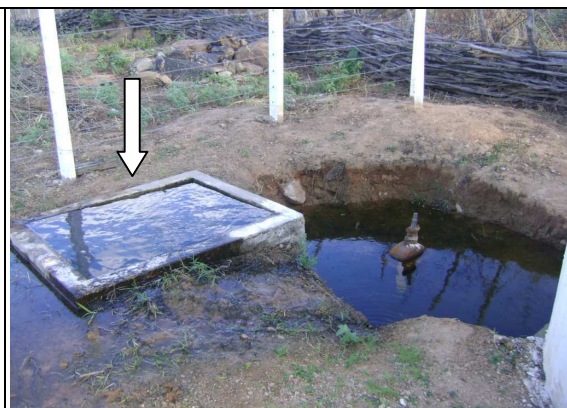
Foto 72 – Tanque de amortecimento unidirecional: caixa de proteção da ventosa, sem tampa.
