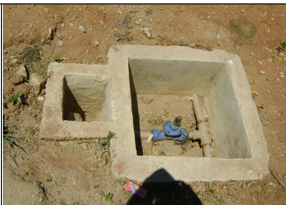
Foto 83 – Registro de descarga localizada na Rua Maria Luísa Barros – São Bernardo: sem tampa na caixa de proteção
