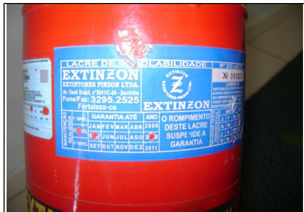
Foto 89 – Extintor de incêndio, fora do prazo de validade.
