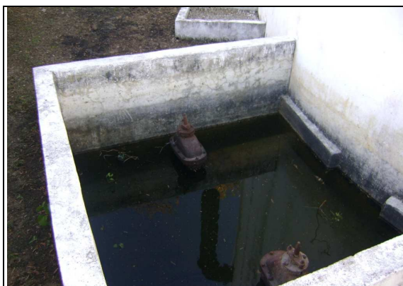
Foto 46 – RAP-01: caixa de proteção de registro sem tampa e com água acumulada.
