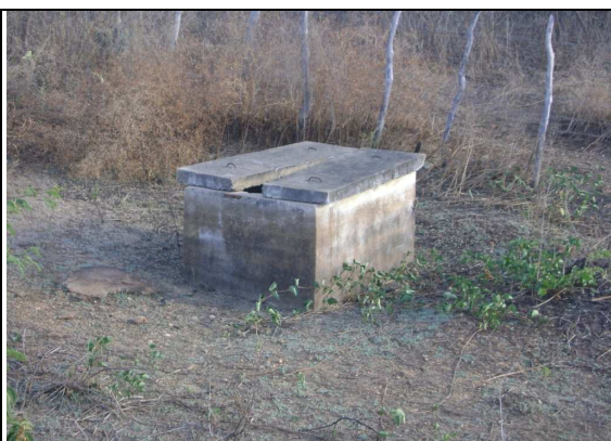
Foto 68 – Adutora de água bruta: caixa de registro de descarga na faixa de domínio da CE-187.
