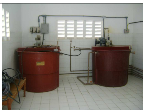
Foto 25 – Tanques de dosagem de produtos químicos.
