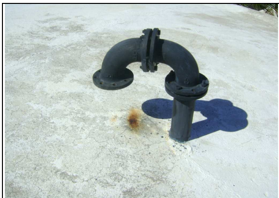
Foto 52 – RAP-03: tubulação de ventilação sem tela de proteção.
