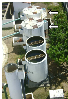
Foto 16 – Pintura deteriorada das tampas de ferro dos filtros nº 05 e 06.
