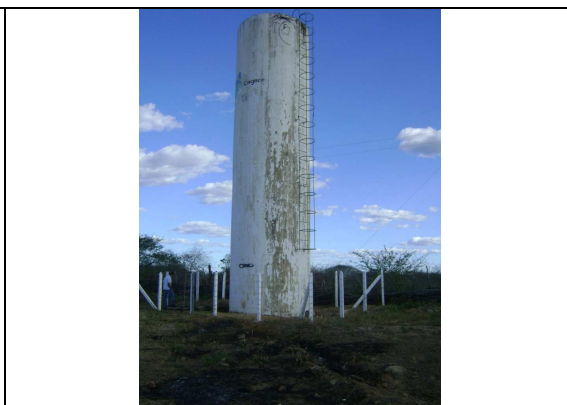
Foto 74 – Tanque de amortecimento unidirecional: pintura deteriorada.
