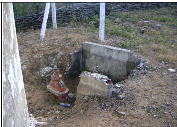
Foto 70 – Tanque de amortecimento unidirecional: caixa de proteção de registro danificada.
