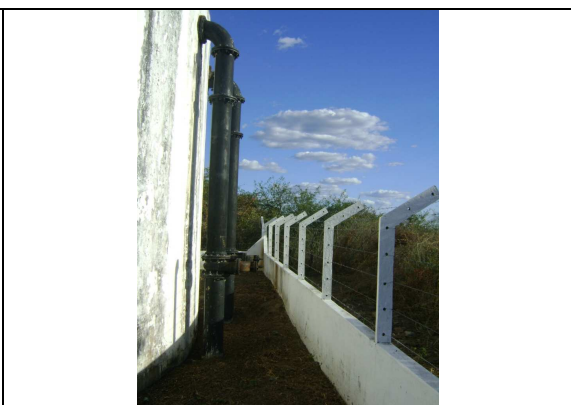
Foto 47 – RAP-01: sinais de vazamento na junção da tubulação.
