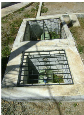
Foto 63 – Estação pitométrica na linha de alimentação do REL-01.
