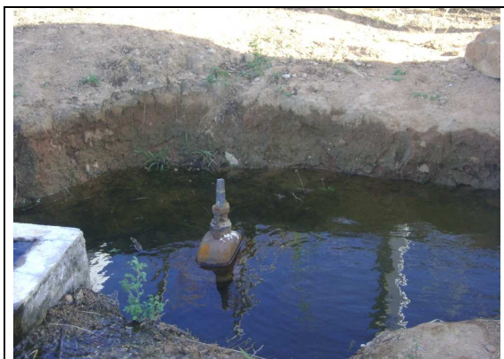
Foto 73 – Tanque de amortecimento unidirecional: registro sem caixa de proteção.
