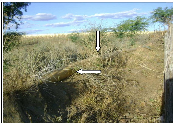
Foto 69 – Adutora de água bruta: tubulação exposta.
