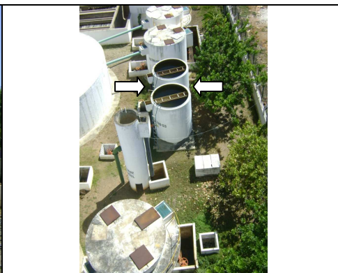
Foto 14 – Filtros nº 03 e 04 sem tampas.
