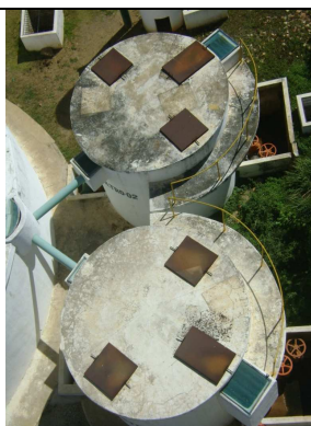
Foto 15 – Pintura deteriorada das tampas de ferro dos filtros nº 01 e 02.
