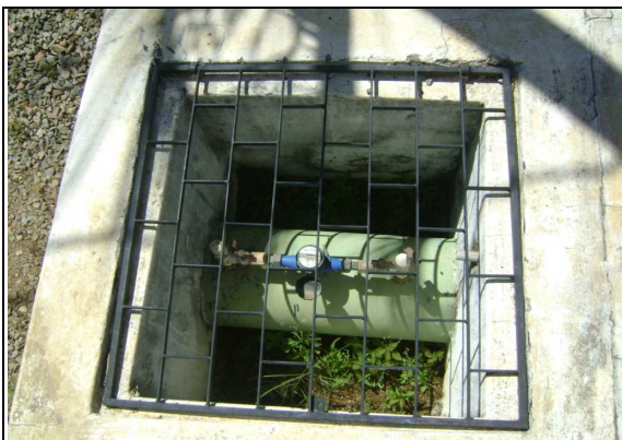
Foto 62 – Macromedidor proporcional na linha de alimentação do REL-01.
