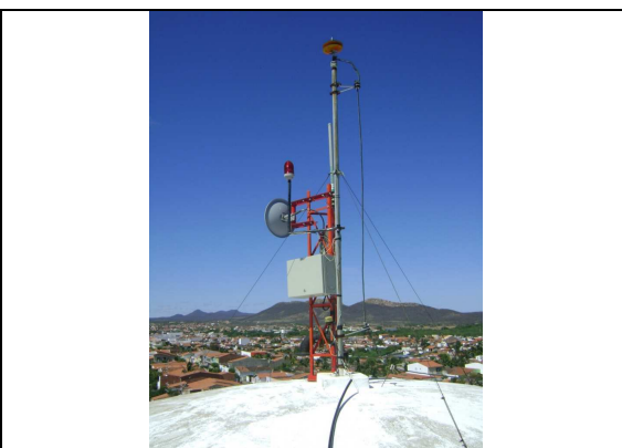
Foto 60 – REL-01: pára-raios e sinalização noturna.
