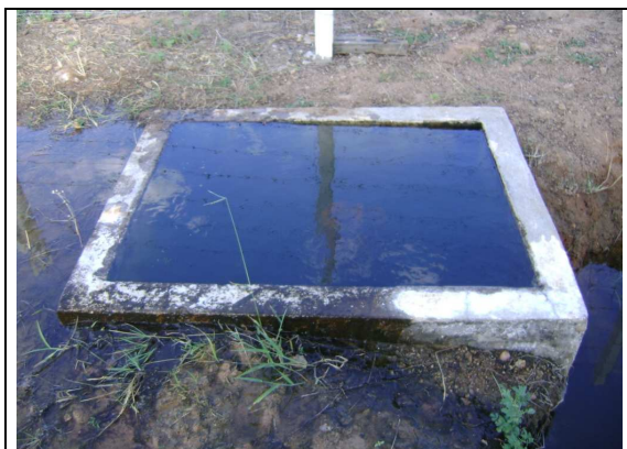
Foto 71 – Tanque de amortecimento unidirecional: sinais de vazamento na ventosa.
