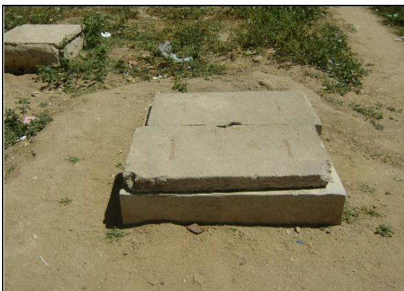
Foto 82 – Registro de descarga localizado na Rua F, Conjunto Habitacional Domingos Gomes.
