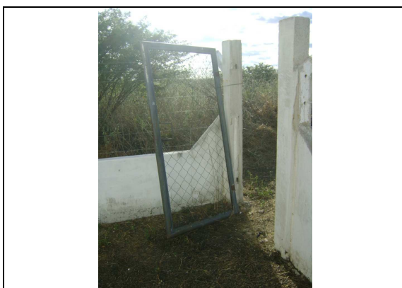
Foto 48 – RAP-01: portão de acesso danificado.
