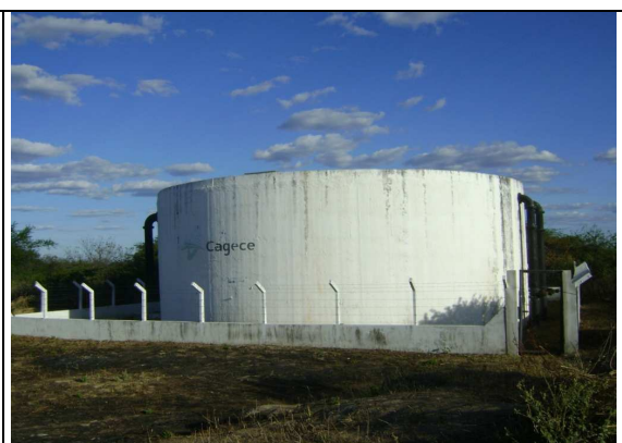
Foto 49 – RAP-01: sem escada de acesso externo.
