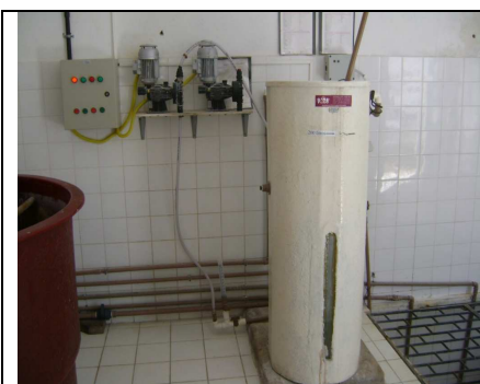
Foto 24 – Sistema de fluoretação: em operação.
