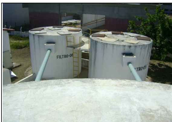
Foto 57 – RAP-03: ligação da alimentação dos filtros nº 05 e 06.
