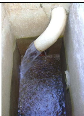
Foto 17 – Registro de descarga do filtro nº 03: sem vedação.
