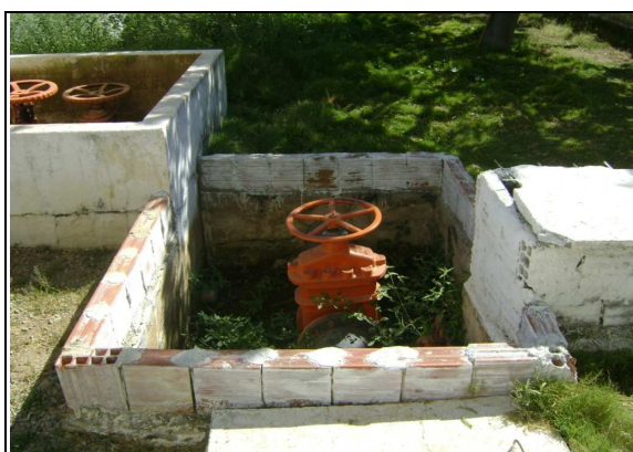
Foto 66 – Caixas de proteção de registros, localizadas na ETA, sem tampas.
