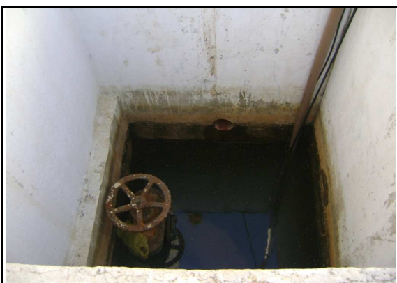
Foto 64 – Caixa de proteção do registro de descarga do RAP-03 com água acumulada.
