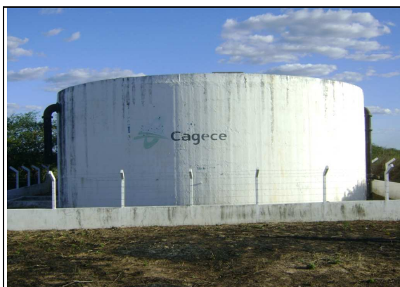
Foto 44 – RAP-01: ausência de identificação e medidor de nível e pintura deteriorada.
