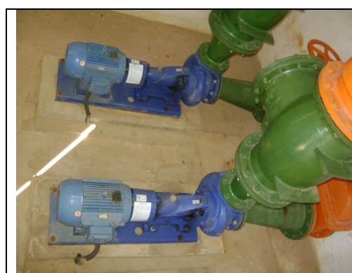
Foto 3 – Conjuntos motores-bomba da estação elevatória do floco-decantador.
