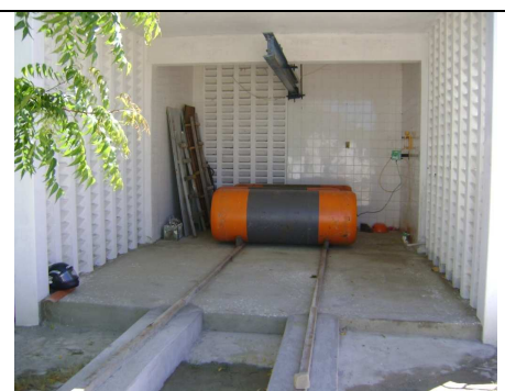
Foto 27 – Casa da estação de cloro gasoso.
