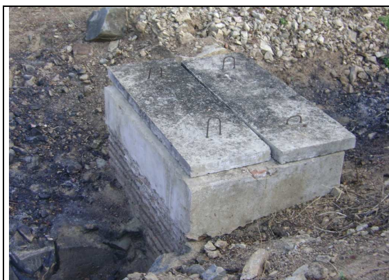
Foto 67 – Adutora de água bruta: caixa de registro de descarga na estrada de acesso à barragem.
