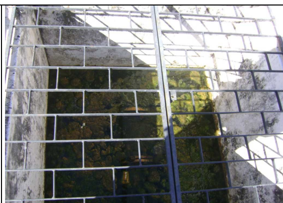
Foto 65 – Caixa de proteção de acessório, localizada na ETA, com água acumulada.
