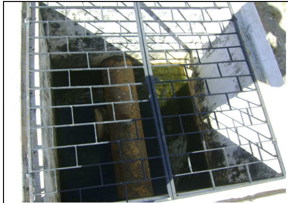
Foto 75 – Estação pitométrica com caixa de proteção cheia de água.
