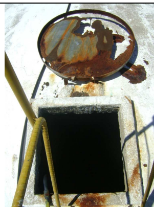
Foto 54 – REL-01: tampa de inspeção deteriorada.
