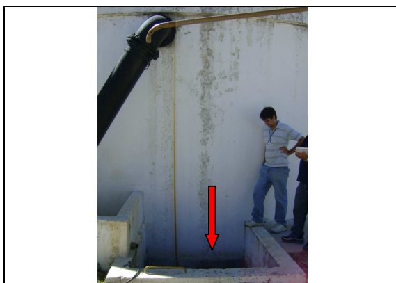
Foto 50 – RAP-02: sinais de vazamento no flange do registro de descarga.
