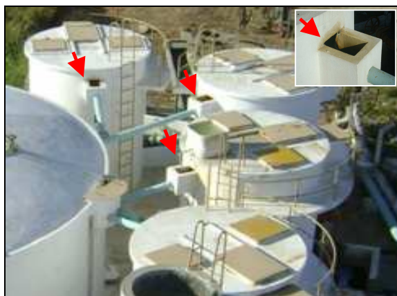
Foto 13 – Filtros 1 a 4: Sem tampa de proteção na caixa de saída da água tratada.
