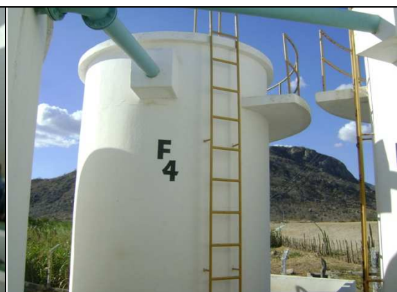
Foto 12 – Filtro 4: Devidamente identificada.
