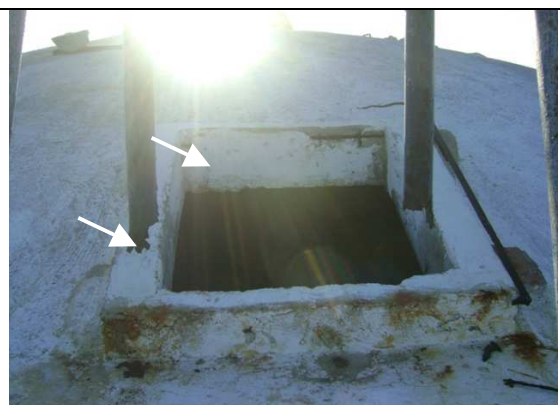
Foto 46 – REL-01: Sem tampa de inspeção e escada de acesso comprometida pela corrosão.
