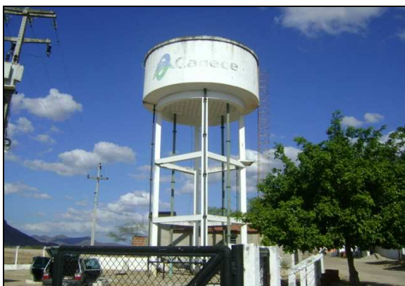
Foto 41 – REL-01: Sem guarda-corpo na laje superior.
