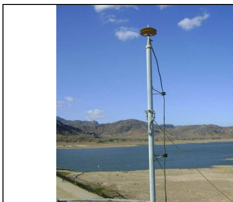
Foto 43 – REL-01: Existência de pára-raio e ausência de sinalizador noturno.
