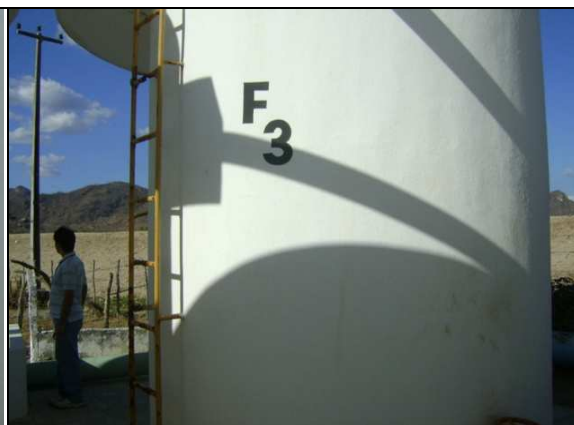
Foto 10 – Filtro 3: Devidamente identificado.
