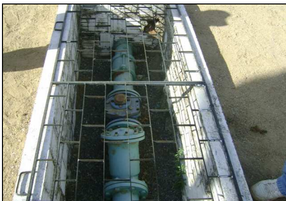
Foto 28 – Macromedidor da adutora de água bruta, localizado na entrada da ETA.
