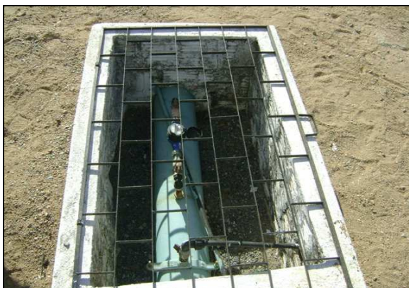
Foto 30 – Medidor proporcional de água tratada, localizado na saída da ETA.
