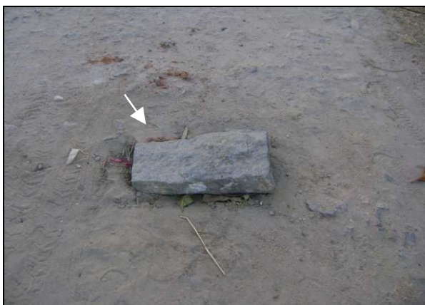
Foto 56 – Registro de descarga localizado na Rua Lucas Batista, apresentando uma pedra como tampa improvisada.
