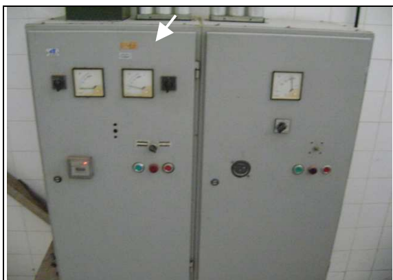
Foto 34 – EECS-02: Quadro de comando.
