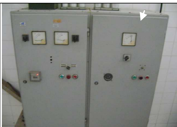
Foto 36 – EEAT-01: Quadro de comando.
