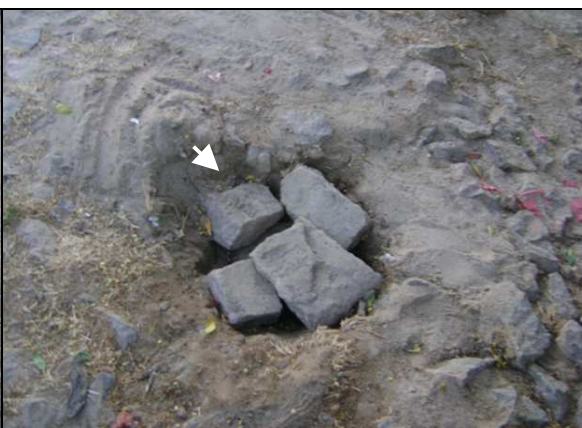
Foto 59 – Registro de descarga localizado na Rua Walmar Braga: sem tampa.
