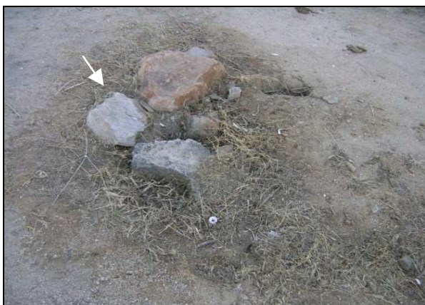
Foto 58 – Registro de descarga localizado na Rua Waldir Andrade Braga: sem caixa e tampa de proteção.
