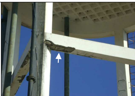
Foto 44 – REL-01: Estrutura de concreto deteriorada.
