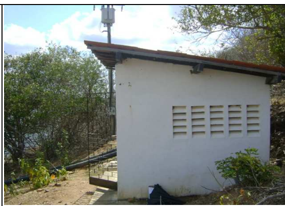
Foto 33 – EECS-01: Casa do quadro de comando - sem identificação.
