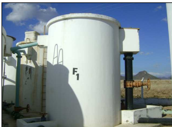
Foto 7 – Filtro 1: Devidamente identificado.
