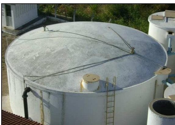
Foto 37 – RAP-01: Sem identificação.
