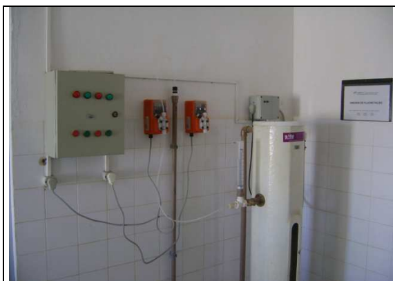
Foto 22 – Dosador de flúor.
