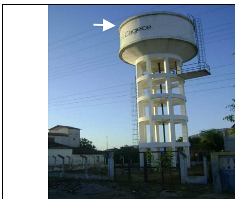
Foto 45 – REL-01: Sem guarda-corpo na laje superior.
