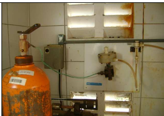
Foto 25 – Dosador de cloro gasoso.
