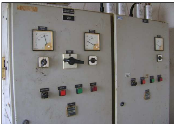
Foto 32 – EECS-01: Quadro de comando.
