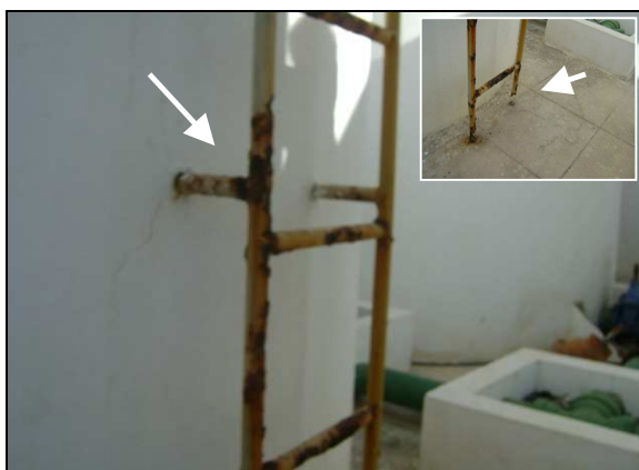
Foto 11 – Filtro 3: Escada de acesso deteriorada pela corrosão.
