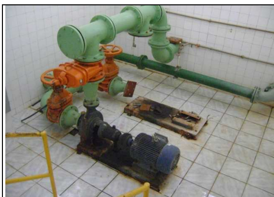
Foto 35 – EEAT-01: Conjunto moto-bomba
