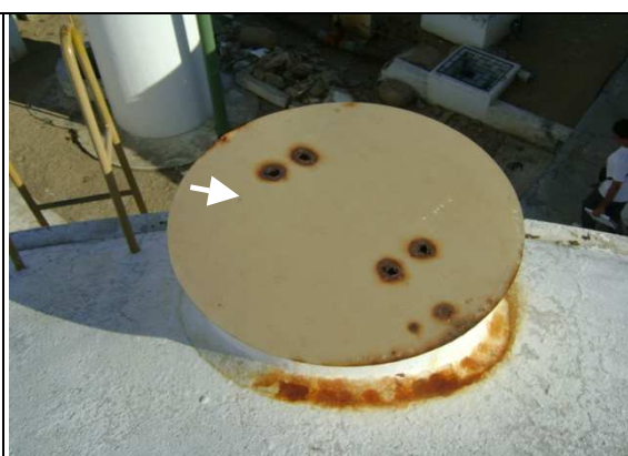
Foto 38 – RAP-01: Tampa de inspeção apresentando orifício.
