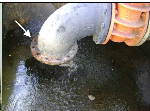
Foto 8 – Filtro 1: Vazamento no registro de descarga.
