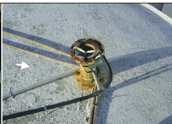
Foto 40 – RAP-01: Tubulação de ventilação inadequada.
