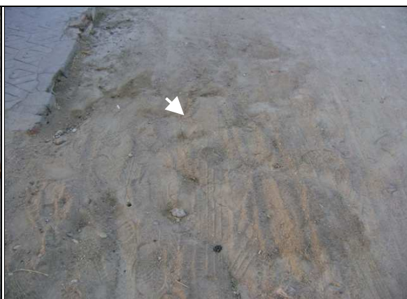
Foto 57 – Registro de descarga localizado na Rua Luis da Mota Melo: soterrado.
