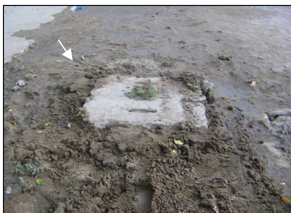
Foto 60 – Registro de descarga localizado na Rua Profa. Dilma Bastos.
