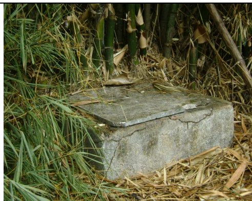
Foto 4 – Caixa de passagem: recepção da água das fontes 03 e 04.
