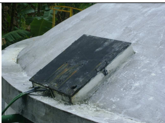
Foto 63 – RAP-01: tampa de inspeção deteriorada.
