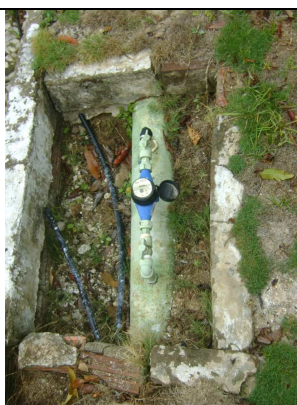
Foto 65 – RAP-01: caixa de proteção de macromedidor proporcional sem tampa.
