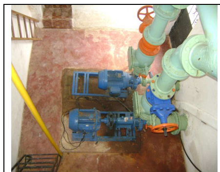
Foto 50 – EEAT-01: conjuntos motores-bomba.
