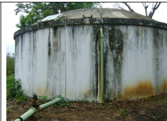
Foto 67 – RAP-02: pintura deteriorada.
