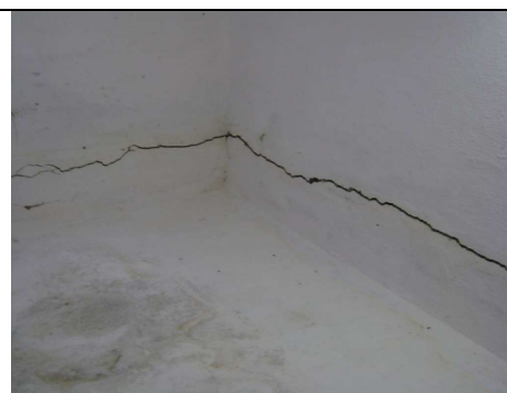
Foto 46 – Rachaduras na parede do laboratório.
