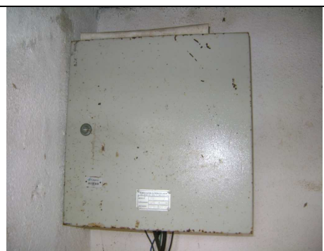
Foto 53 – EEPR-01: quadro de comando sem horímetro.
