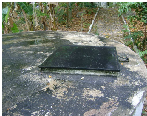
Foto 12 – Tampa de inspeção da nascente da fonte F-05.
