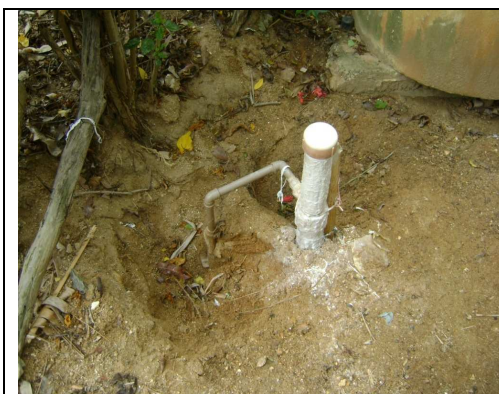
Foto 30 – PT-08: clorador de pastilha sem caixa de proteção.
