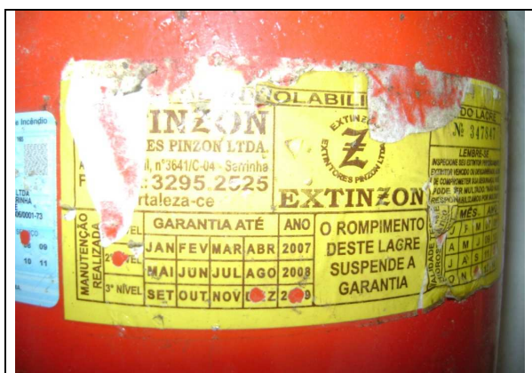
Foto 87 – Extintor de incêndio, fora do prazo de validade.
