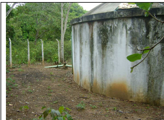
Foto 68 – RAP-02: ausência de escada de acesso externo.
