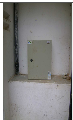
Foto 28 – PT-08: quadro de comando sem horímetro.
