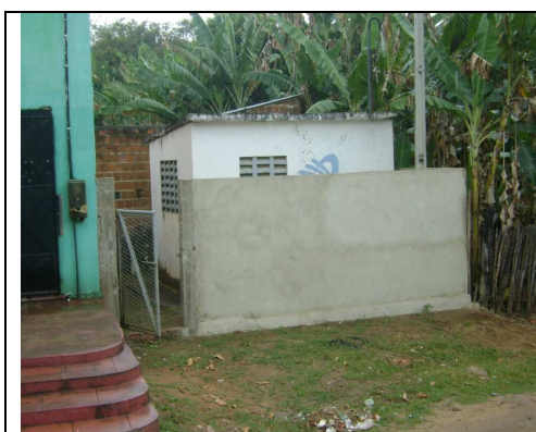
Foto 55 – EERD-booster: sem identificação.
