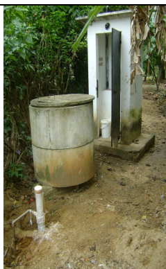
Foto 26 – PT-08: sem identificação e pintura deteriorada.
