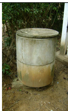
Foto 29 – PT-08: pintura deteriorada da caixa de proteção do poço.
