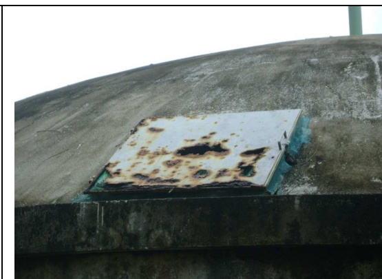
Foto 69 – RAP-02: tampa de inspeção deteriorada.
