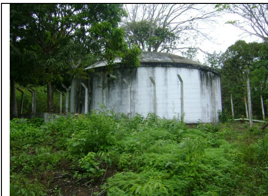
Foto 66 – RAP-02: ausência de placa de identificação da área.
