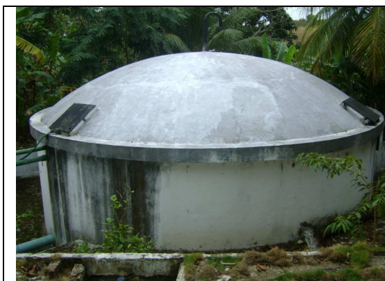
Foto 62 – RAP-01: pintura deteriorada.
