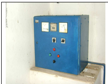
Foto 51 – EERD-booster: quadro de comando com horímetro.
