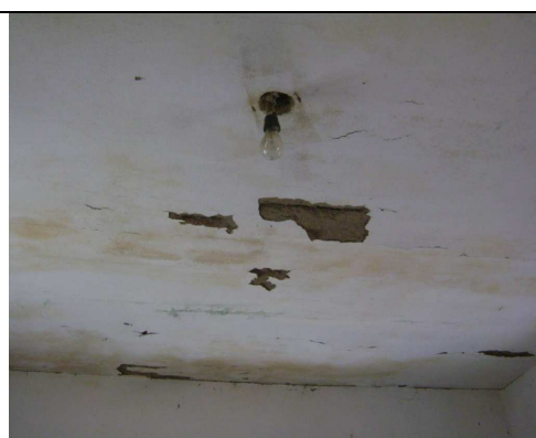
Foto 56 – EERD-booster: instalação elétrica defeituosa.
