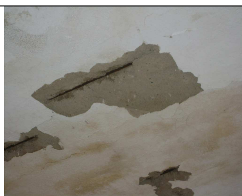
Foto 58 – EERD-booster: ferragem exposta na laje do teto.
