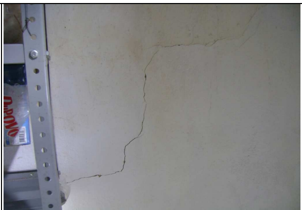
Foto 52 – Fissuras na parede do almoxarifado.
