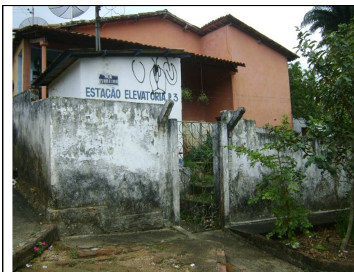
Foto 17 – PT-03: pintura externa da casa de proteção do quadro de comando, deteriorada.
