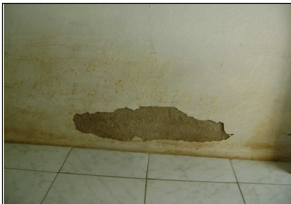
Foto 51 – Falhas no reboco da parede do escritório.
