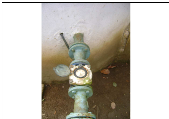
Foto 44 – Macromedidor Woltmann na linha de adução da EEPA-01 / 02 com o REL-01.
