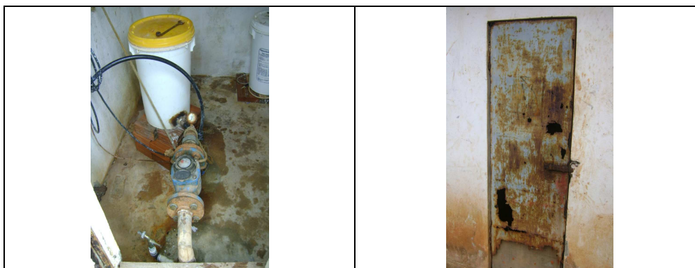
Foto 6 – PT-01: pintura do barrilete do poço, deteriorada.
