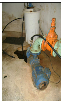
Foto 30 – EEPA-01 e 02: ausência de conjunto motor-bomba reserva.
