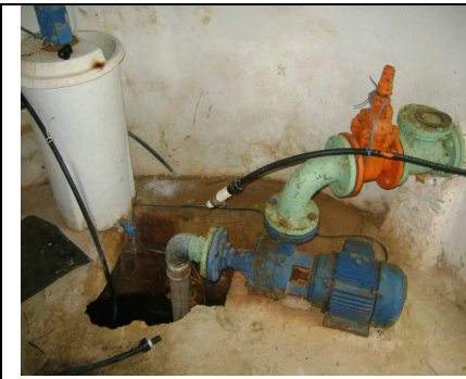
Foto 31 – EEPA-01 e 02: pintura dos equipamentos, deteriorada.
