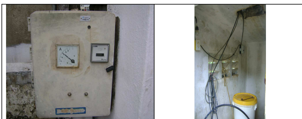
Foto 8 – PT-01: pintura do quadro de comando, deteriorada.
