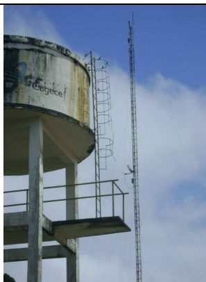
Foto 37 – REL-01: pintura deteriorada.
