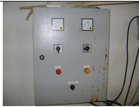
Foto 32 – EEPA-01 e 02: pintura do quadro de comando, deteriorada.
