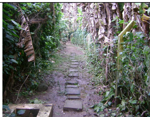
Foto 20 – PA-01 e 02: ausência de iluminação externa.
