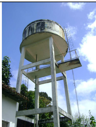
Foto 36 – REL-01: sem guarda corpo na laje de cobertura.
