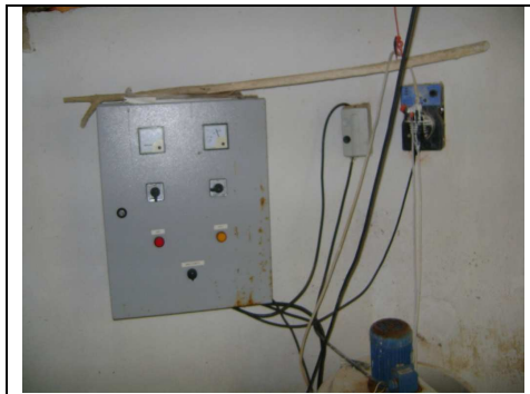
Foto 33 – EEPA-01 e 02: quadro de comando sem horímetro, e fiação e cabeamento instalados de forma inadequada.
