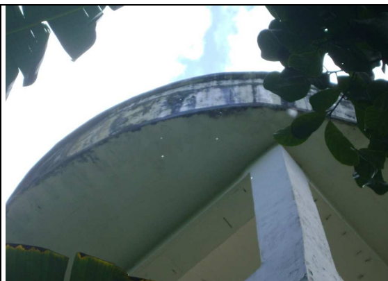
Foto 39 – REL-01: armadura exposta.
