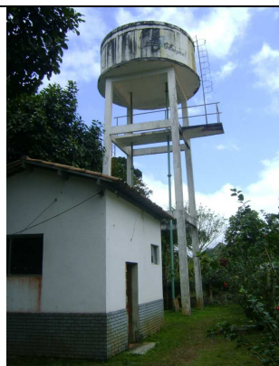
Foto 38 – REL-01: sinais de extravasamento.
