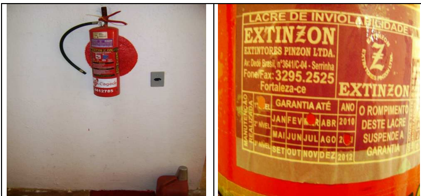
Fotos 12 e 13 – Extintor de incêndio
