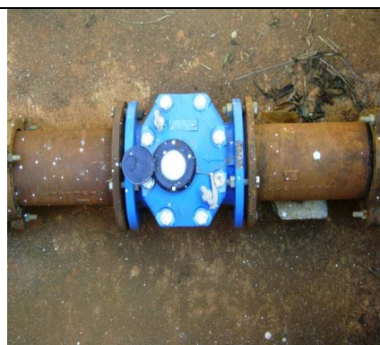
Foto 30 – Macromedidor na saída do RAP-01
