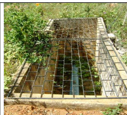
Foto 29 – Estação pitométrica na adutora de água bruta
