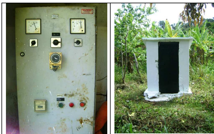
Fotos 19 e 20 – EECS-01 - quadro de comando e sua casa de proteção
