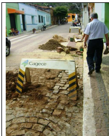
Foto 40 – Vazamentos na rede de distribuição
