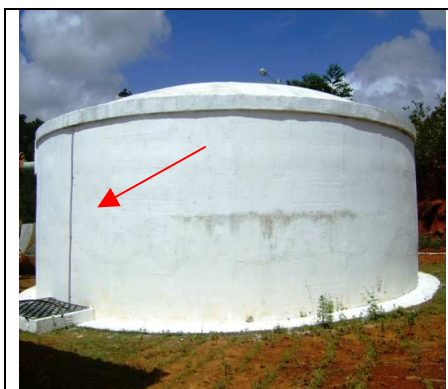
Foto 28 – RAP-01 – medidor de nível
