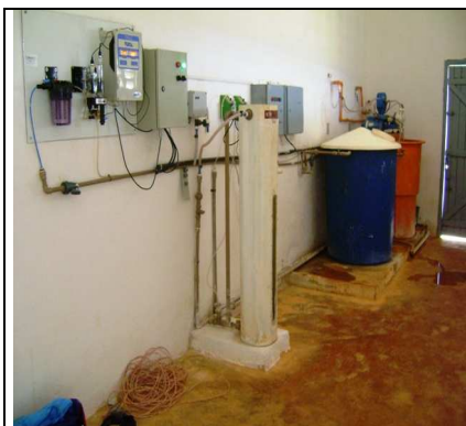
Foto 10 – Sistema de fluoretação e tanques dosadores
