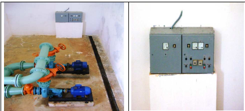
Fotos 21 e 22 – EELF-01 – conjuntos motores-bomba e quadro de comando
