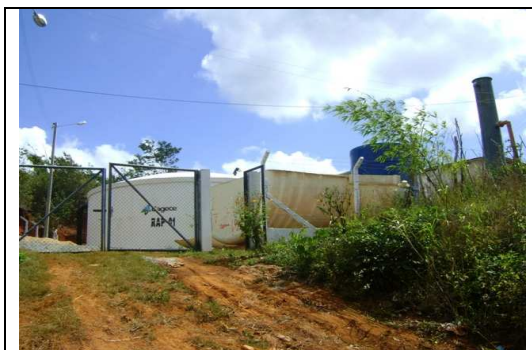
Foto 4 – Vista da entrada da ETA do SAA de Meruoca
