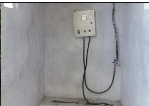
Foto 24 – Quadro de comando da EECS-01.
