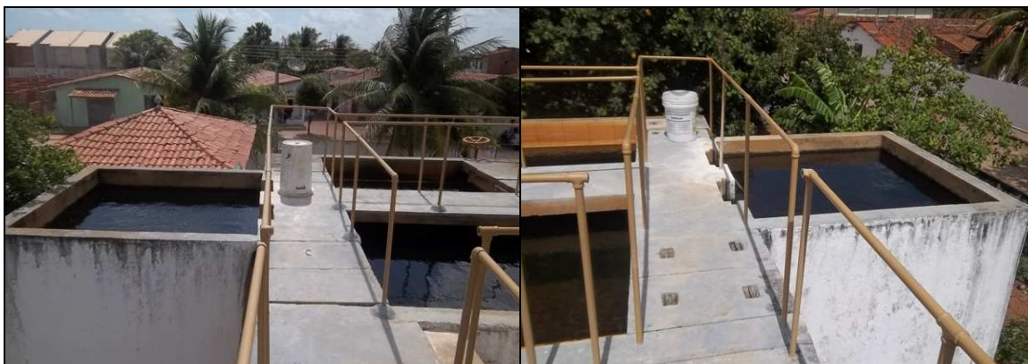
Fotos 5 e 6 – Guarda-corpos e câmaras dos floccodecantadores.
