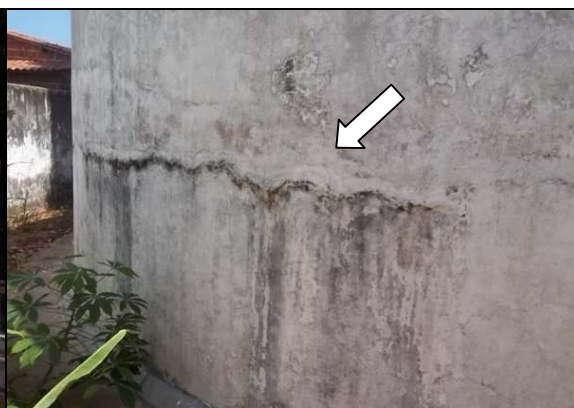
Foto 30 – Infiltração na parede do RAP-01.
