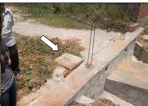
Foto 45 – Registro de descarga localizado na Rua SDO, Boa Esperança.
