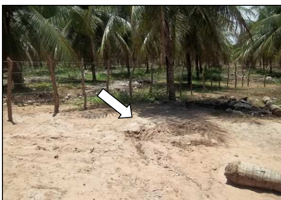
Foto 44 – Registro de descarga soterrado e sem caixa de proteção, localizado na Rua Antônio Tabosa, Lagoa de Beber.
