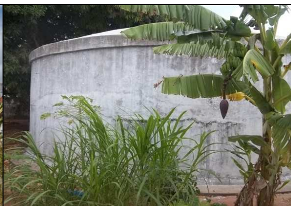
Foto 35 – Infiltração na parede do RAP-02.
