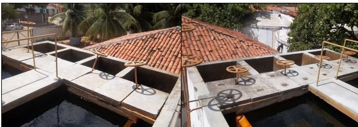
Fotos 8 e 9 – Vistas dos filtros 01 a 08.
