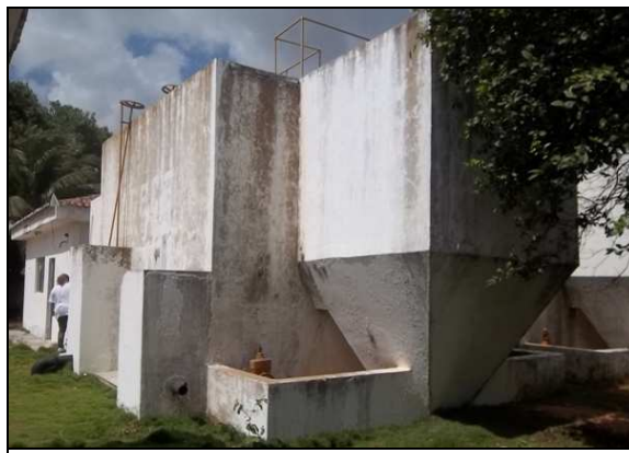
Foto 4 – Vista dos floccodecantadores.
