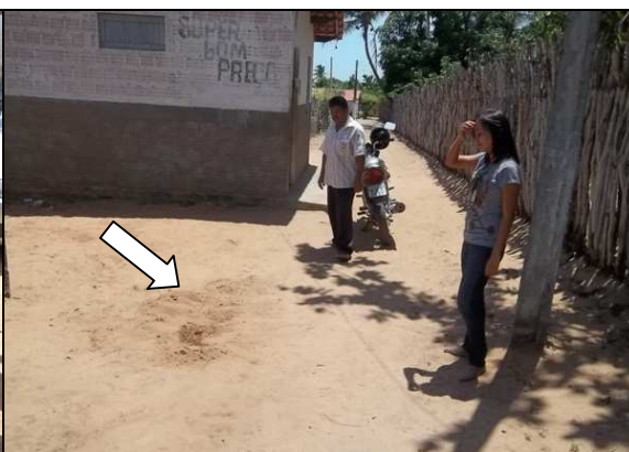
Foto 43 – Registro de descarga soterrado e sem caixa de proteção, localizado na Rua SDO 15, Cana Brava.
