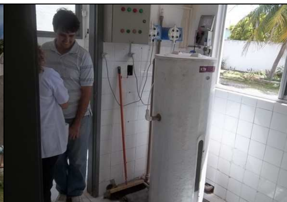
Foto 11 – Dosador de flúor.
