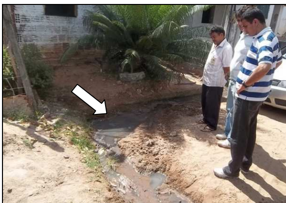
Foto 42 – Registro de descarga soterrado, sem caixa de proteção e coberto por águas servidas, localizado na Rua José Carneiro de Meireles, Boa Esperança.
