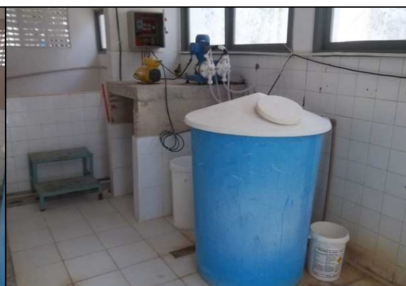
Fotos 13 – Dosador de cloro.
