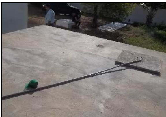
Foto 29 – Tampa de inspeção e ventilação do RSE-01.
