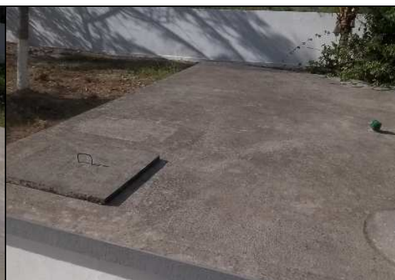
Foto 30 – Tampa de inspeção e ventilação do RSE-02.
