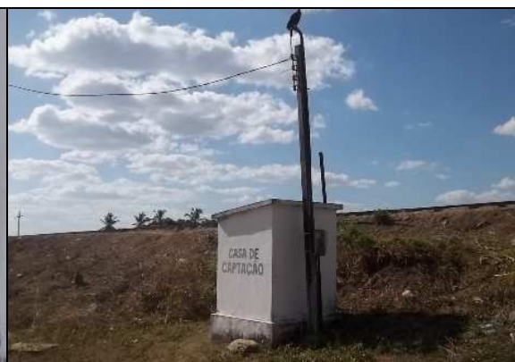
Foto 23 – Casa de abrigo do quadro da EECS-01.
