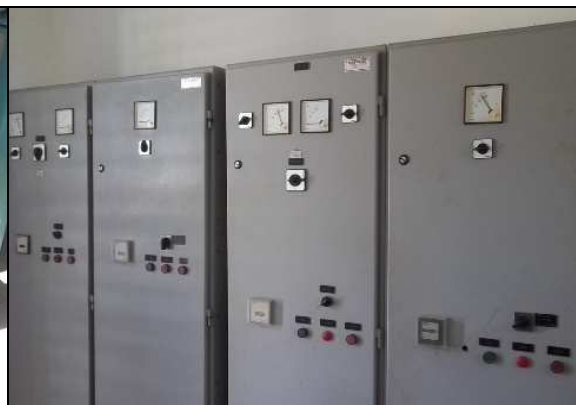
Foto 25 – Quadros de comando das EELF-01 e EEAT-01.
