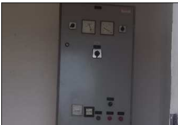
Foto 22 – Quadro de comando da EECS-01.
