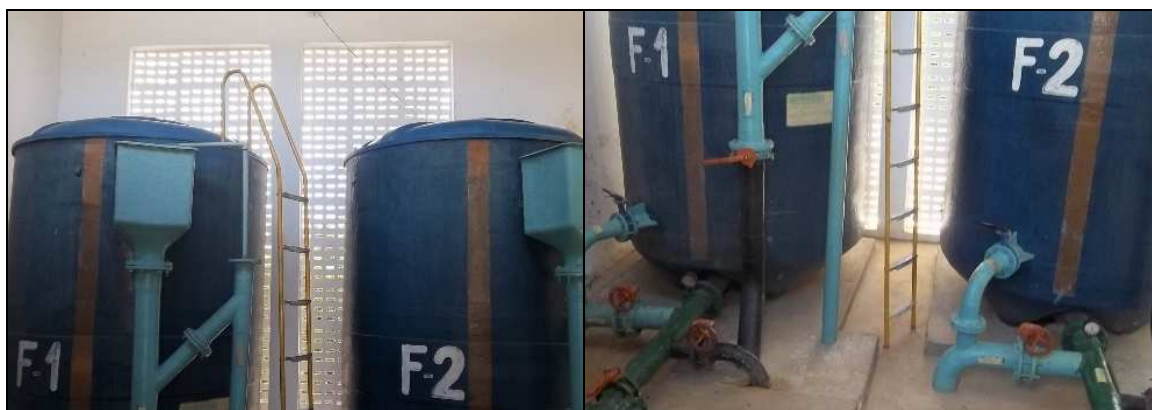
Fotos 3 e 4 – Vistas dos Filtros 01 e 02.
