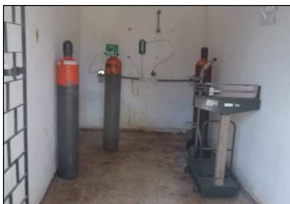
Foto 9 – Cilindros e dosador de Cloro gasoso.
