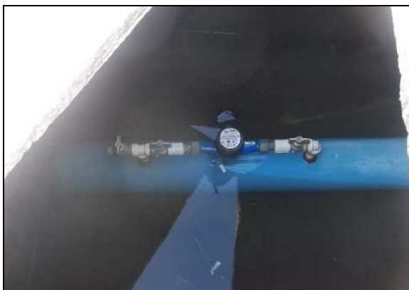
Foto 34 – Caixa do medidor proporcional de água tratada na saída da ETA, cheia d'água.
