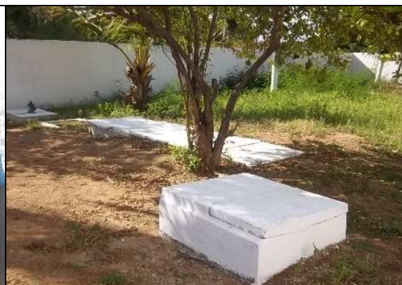
Foto 35 – Caixa do medidor proporcional de água tratada na saída da ETA.
