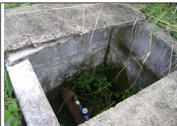
Foto 15 – Medidor proporcional de água bruta, localizado na entrada do tratamento (RAP-02).
