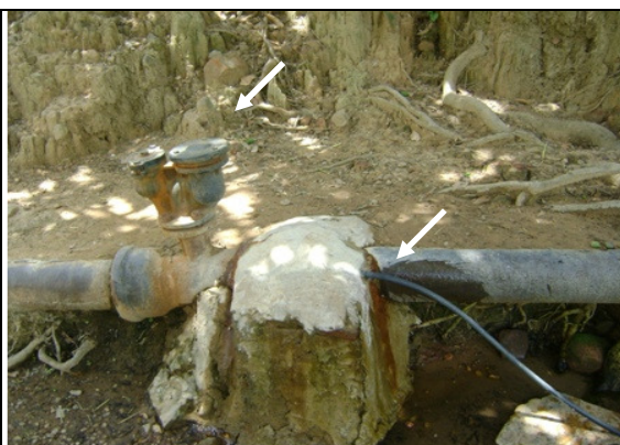
Foto 14 – Ventosa da adutora de água bruta sem caixa de proteção e com tubulação clandestina de retirada de água.
