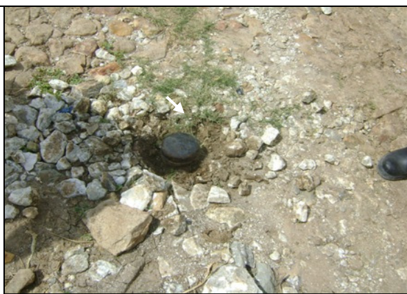
Foto 32 – Registro de descarga localizado na Rua São Pedro: sem caixa de proteção.
