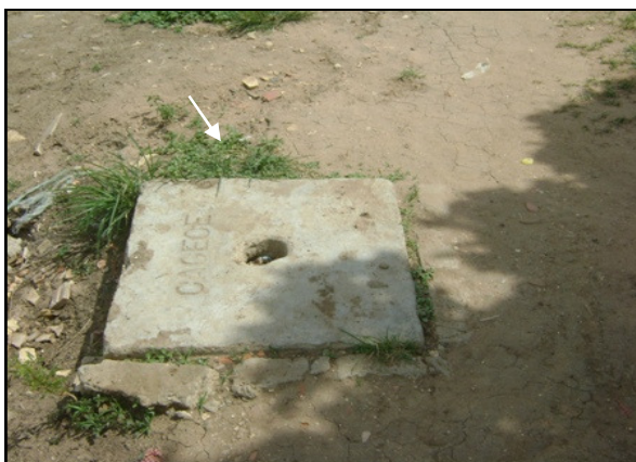
Foto 31 – Registro de descarga localizado na Vila da Cidadania.
