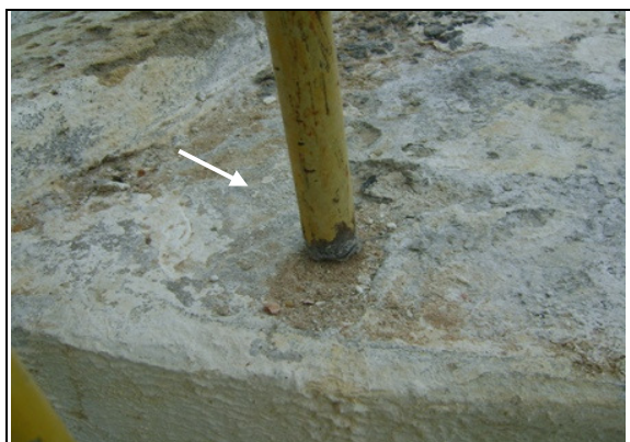
Foto 23 – RAP-02: Escada de acesso solta.
