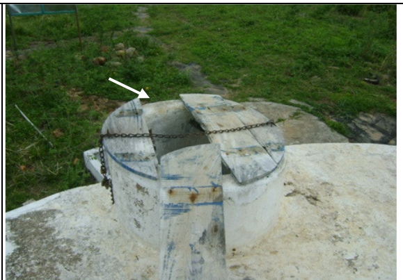
Foto 20 – RAP-02: Tampa de visita danificada.
