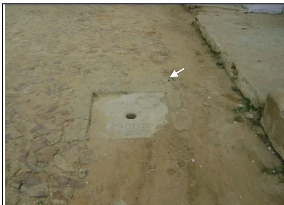
Foto 27 – Registro de descarga localizado na Rua Luís Leopoldino.
