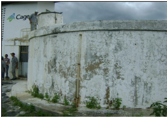
Foto 19 – RAP-02: Sem identificação e com pintura deteriorada.
