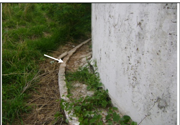
Foto 24 – RAP-02: Calçada danificada.
