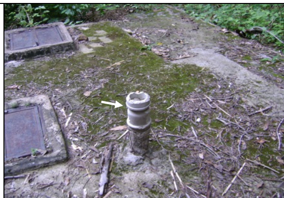
Foto 18 – Tubulação de ventilação inadequada.
