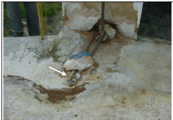
Foto 21 – RAP-02: Entrada de solução de hipoclorito inadequada.
