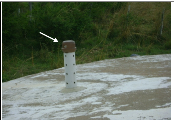
Foto 22 – RAP-02: Tubulação de ventilação inadequada.
