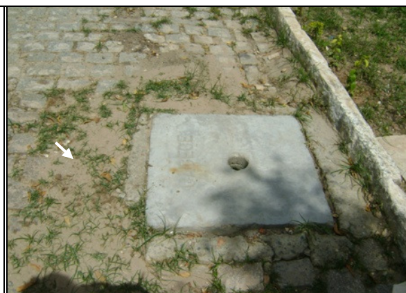
Foto 30 – Registro de descarga localizado na Rua Senhora Santana.
