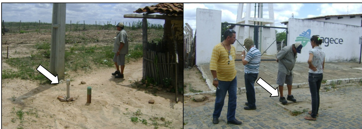
Foto 38 – Registro de descarga, sem caixa de proteção, localizado na Rua Aluísio Ferreira Claudino, Centro.
