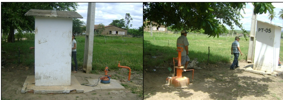
Fotos 22 e 23 – Elevatória EEPT-05 e prédio de abrigo do quadro de comando.
