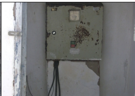
Foto 20 – Quadro de comando da EEPT-04.
