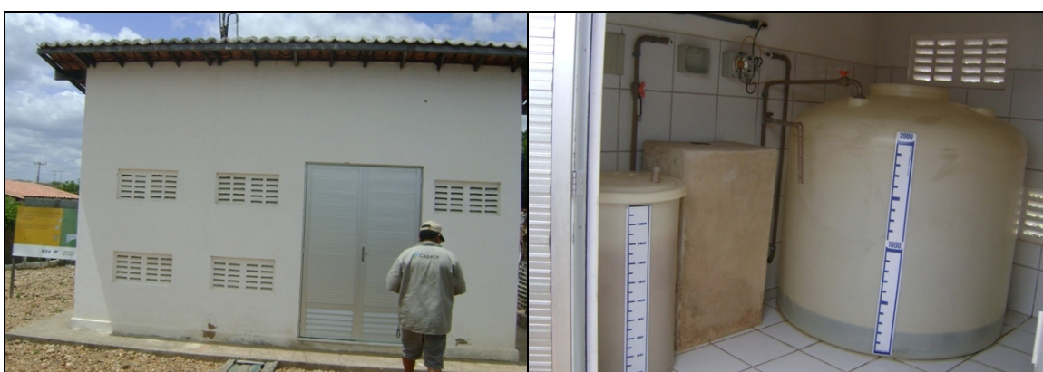
Fotos 8 e 9 – Vistas da fábrica de cloro desativada.
