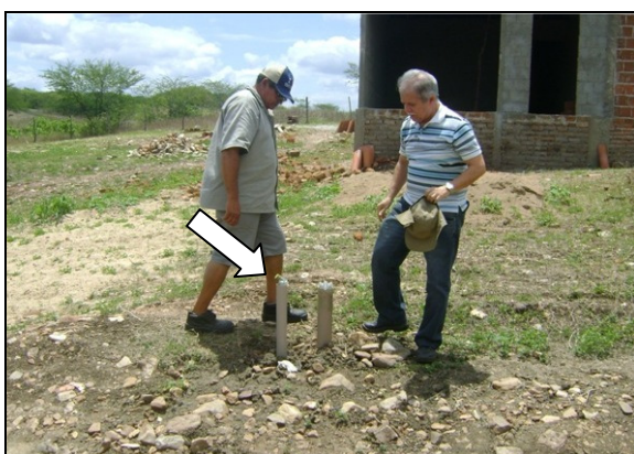
Foto 34 – Registro de descarga, sem caixa de proteção, localizado na Rua Manoel Alves, Centro.
