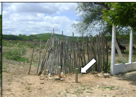
Foto 37 – Registro de descarga, sem caixa de proteção, localizado na Rua Cel. José Ribeiro Crispim, Centro.
