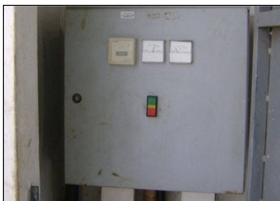
Foto 24 – Quadro de comando da EEPT-05.
