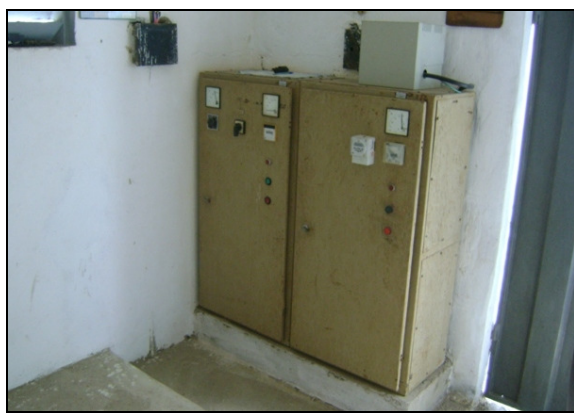
Foto 18 – Quadro de comando da EEPA-01.
