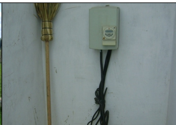
Foto 26 – Quadro de comando da EEPT-07.
