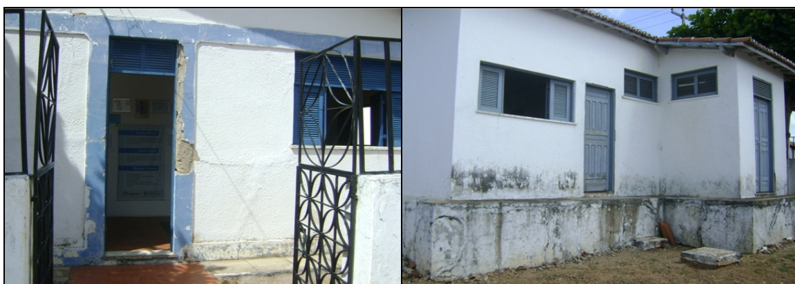
Fotos 41 e 42 – Pintura e revestimento externo do escritório da CAGECE deteriorados.
