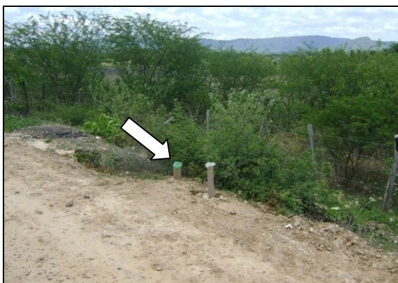
Foto 36 – Registro de descarga, sem caixa de proteção, localizado na Rua Nova dos Aquinos, Centro.
