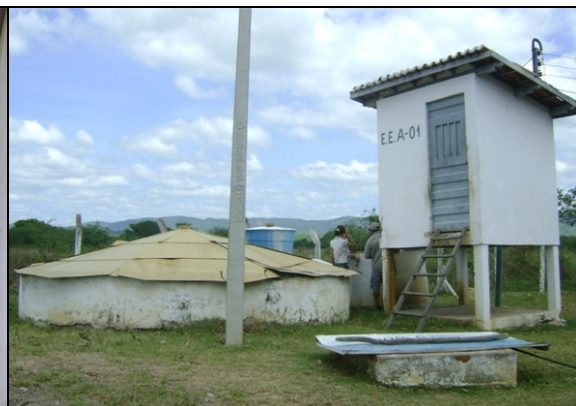
Foto 17 – Poço amazonas e prédio de abrigo da EEPA-01.
