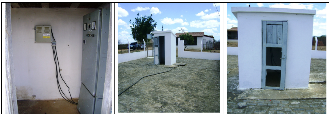
Fotos 26, 27 e 28 – EECS-01 - casa de abrigo do quadro de comando
