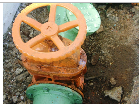
Foto 9 – Registro com vazamento
