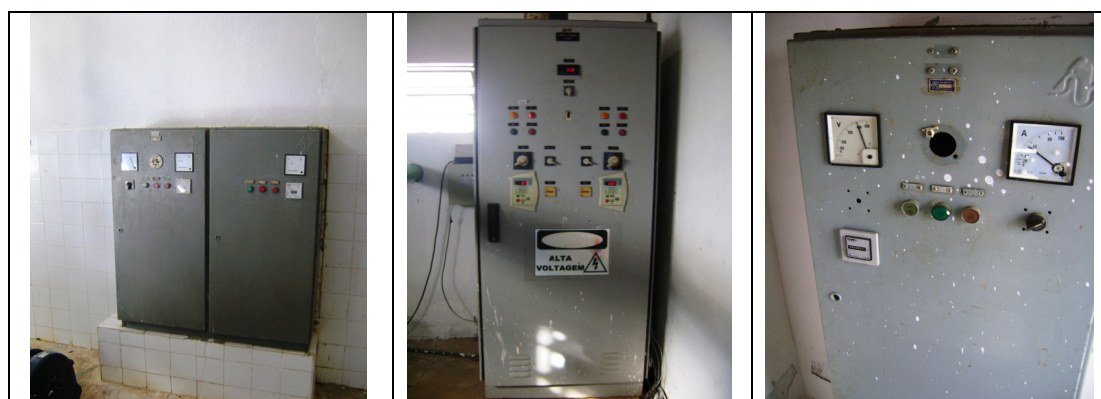
Fotos 23, 24 e 25 – Quadros de comando da EELF-01, EEAT-01 e EECS-01
