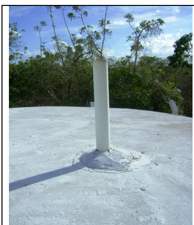
Foto 33 – RAP-02 - tubulação de ventilação inadequada
