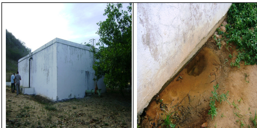
Fotos 34 e 35 – RAP-03 – vista lateral e detalhe de vazamento
