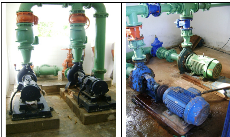
Fotos 21 e 22 – EELF-01 e EEAT-01 – conjuntos motores-bomba
