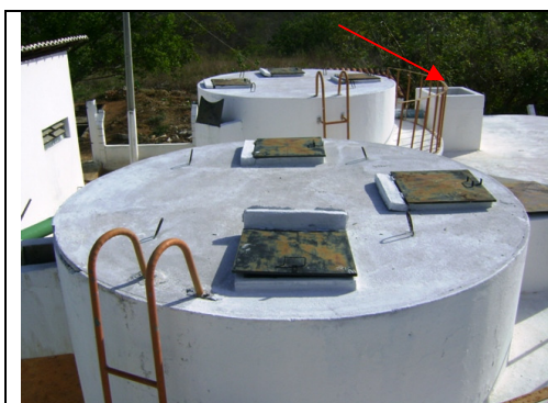
Foto 8 – Calha de saída de água filtrada do filtro F-3
