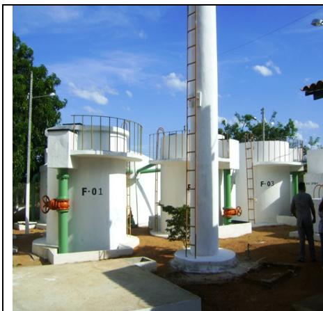
Foto 6 – Vista da torre de equilíbrio e dos filtros
