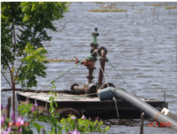
Foto 3 – EECS-01: ausência de bomba reserva.
