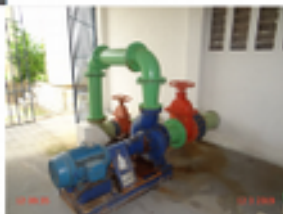
Foto 1 – EEAT-01 e EELF-01: ausência de bomba reserva.
