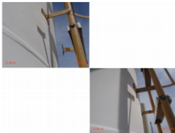
Foto 5 – F-01 e F-02: escadas sem fixação adequadas.
