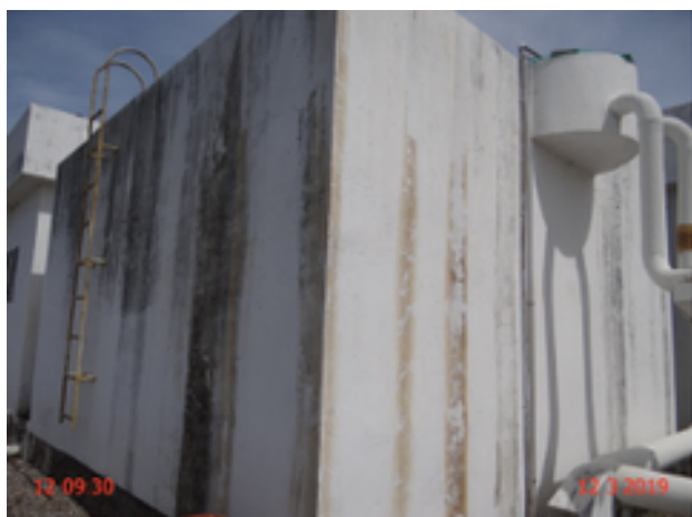
Foto 10 - RAP-01: pintura deteriorada e ausência de identificação.
