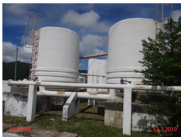
Foto 9 - F-01 e F-02: ausência de identificação
