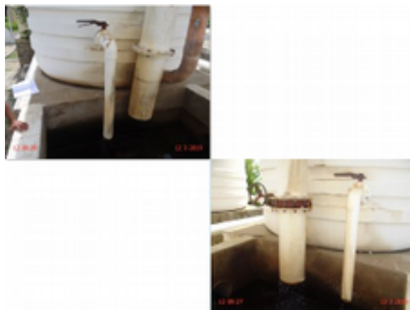
Foto 7 - F-01 e F-02: registros sem vedação.
