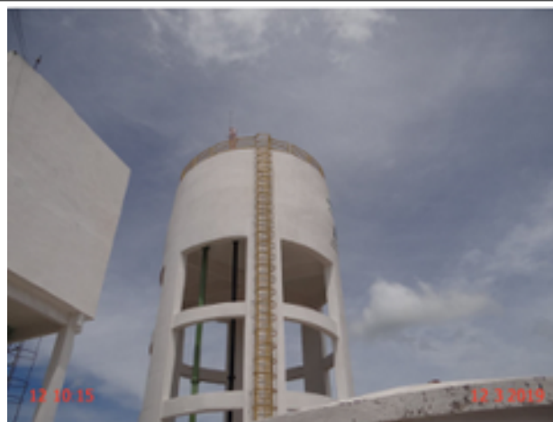
Foto 11 – REL-11: ausência de identificação.
