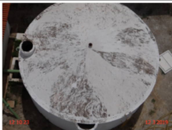
Foto 2 – RSE-01: ausência de tela na tubulação de ventilação e de tampa de vedação no reservatório.
