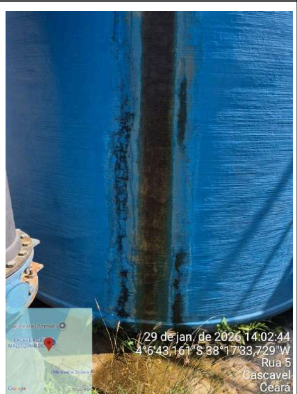
Foto 30 - ETA-02 (Sede): filtros com fibra desgastada e vazamento.
