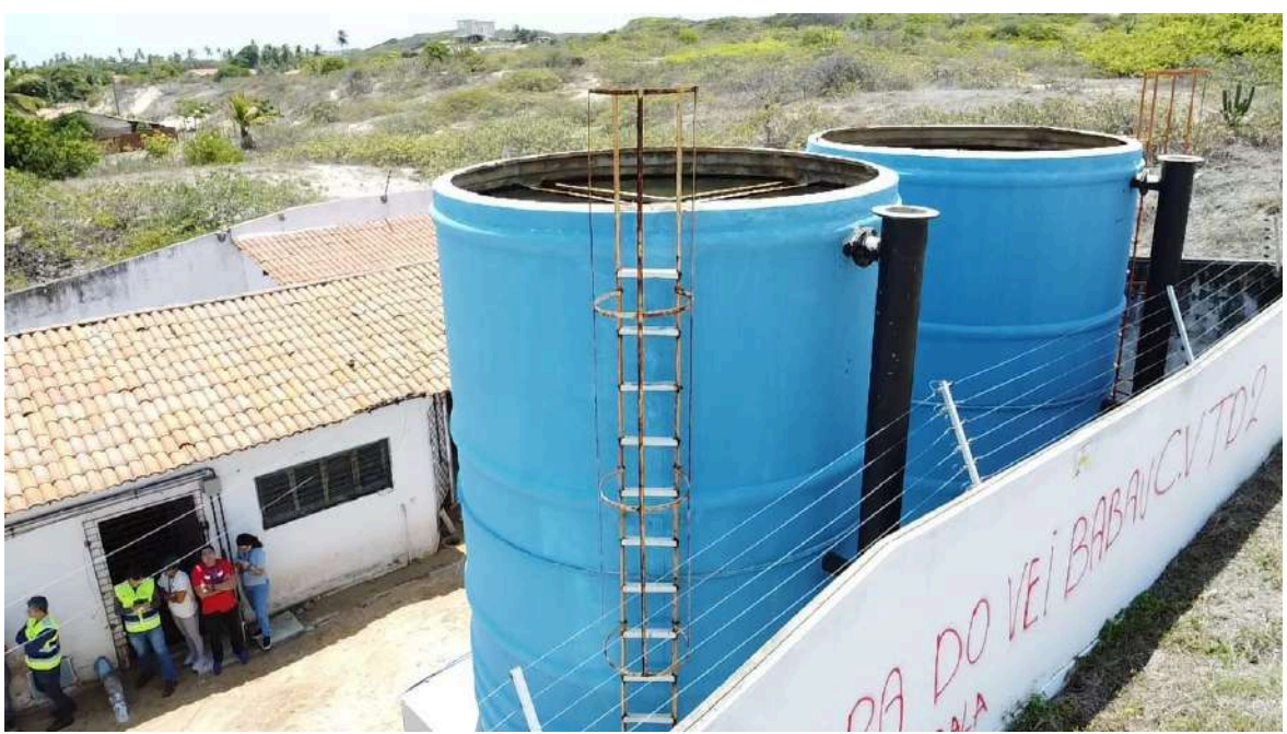
Foto 35 - ETA (Caponga): filtros com escadas oxidadas.
