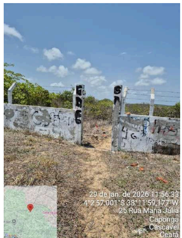
Foto 39 - RAP-02 (Caponga): sem portão de entrada, com paredes da cerca e do RAP desgastadas.
