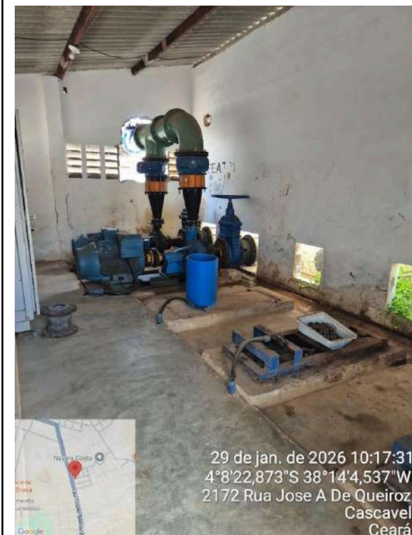
Foto 19 - ETA-01 (Sede): parede da casa de bomba quebrada, com aberturas inadequadas e tinta desgastada.
