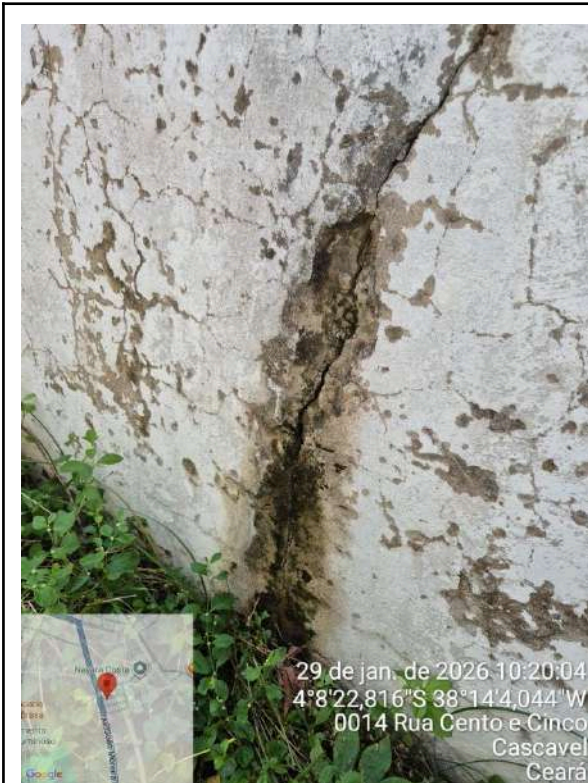
Foto 13 - ETA-01 (Sede): RAP-01 com paredes desgastadas, rachadura reparada paliativamente.
