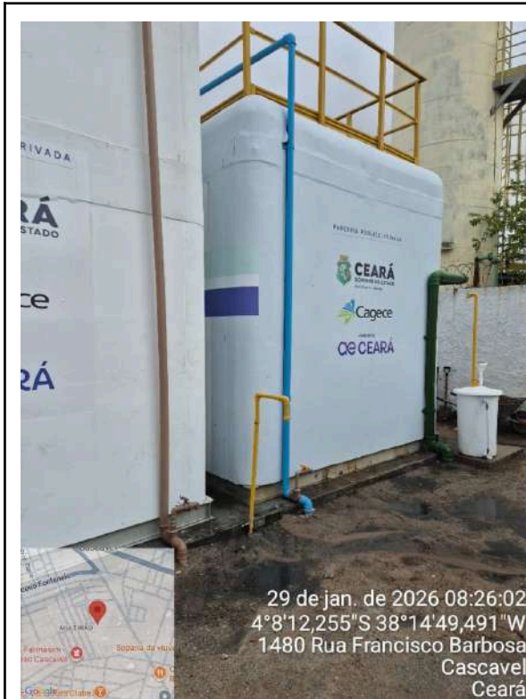
Foto 43 - ETE Cascavel (Sede): Reatores UASB 1 e 2 com vazamento.
