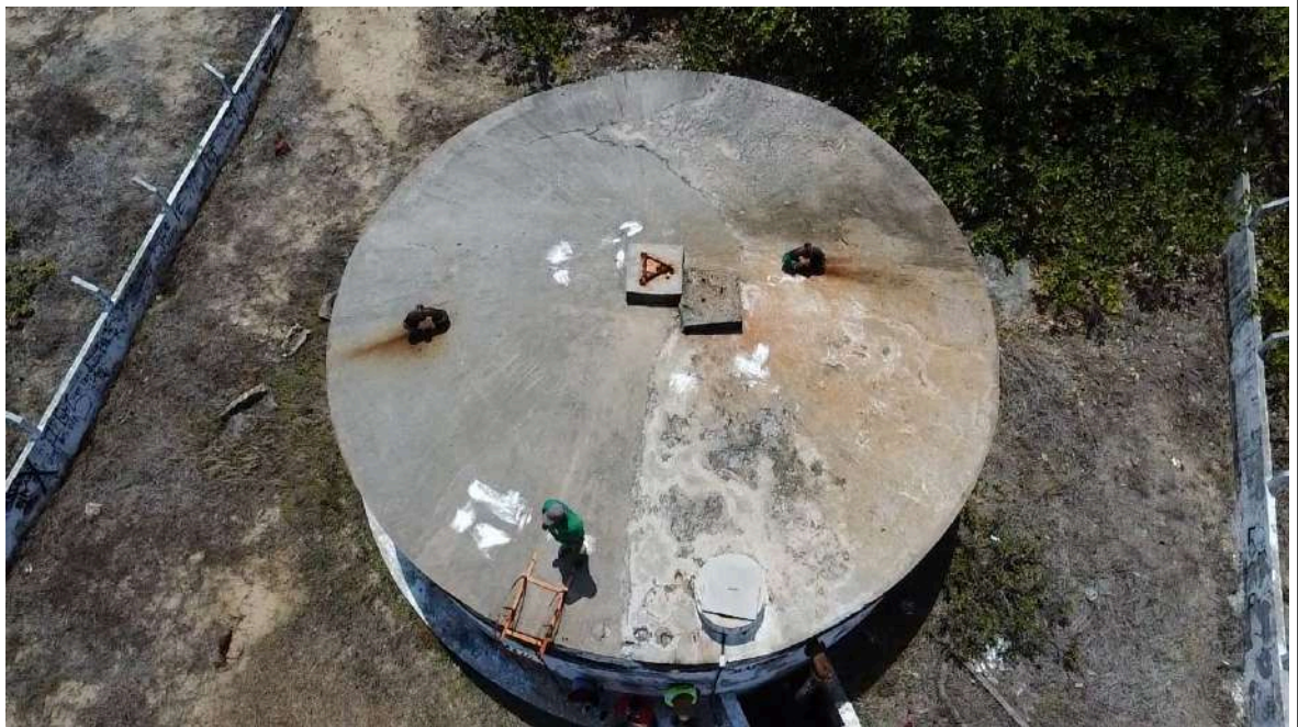
Foto 42 - RAP-02 (Caponga): escada e respiros oxidados.
