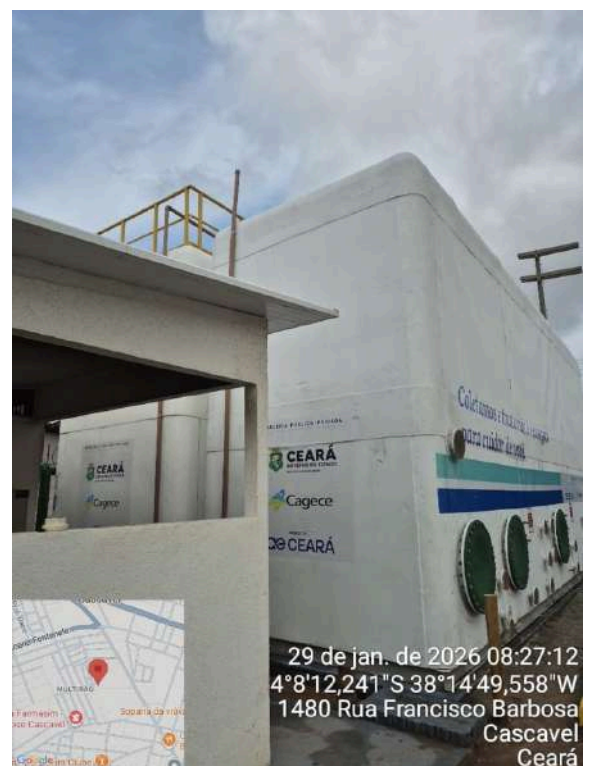
Foto 46 - ETE Cascavel (Sede): Reator 3 não está operando.
