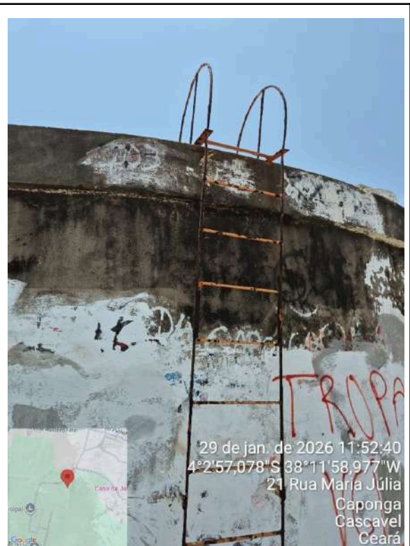
Foto 41 - RAP-02 (Caponga): escada e respiros oxidados.
