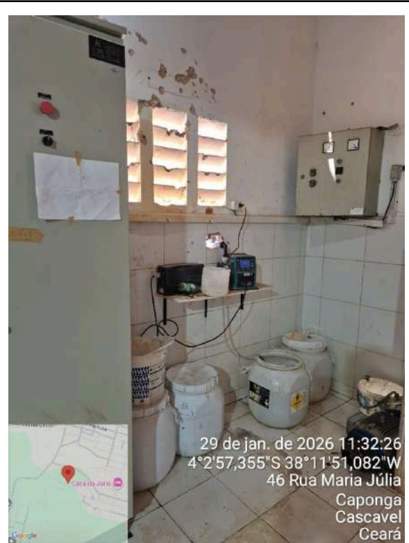
Foto 37 - ETA (Caponga): acúmulo de bombonas em local inadequado.
