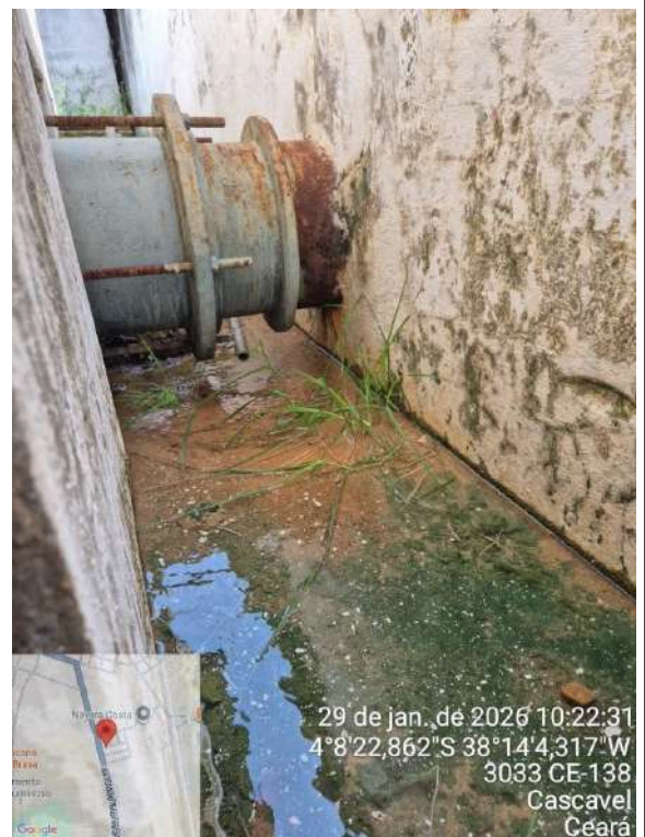
Foto 16 - ETA-01 (Sede): RAP-01 com tubulação oxidada.
