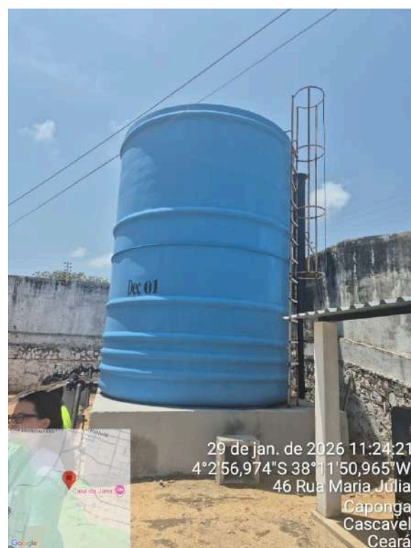
Foto 33 - ETA (Caponga): decantador com escada oxidada.
