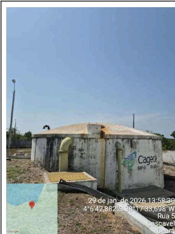
Foto 27 - ETA-02 (Sede): RAP-02 com pintura desgastada e presença de ferrugem apresentando risco de contaminação.
