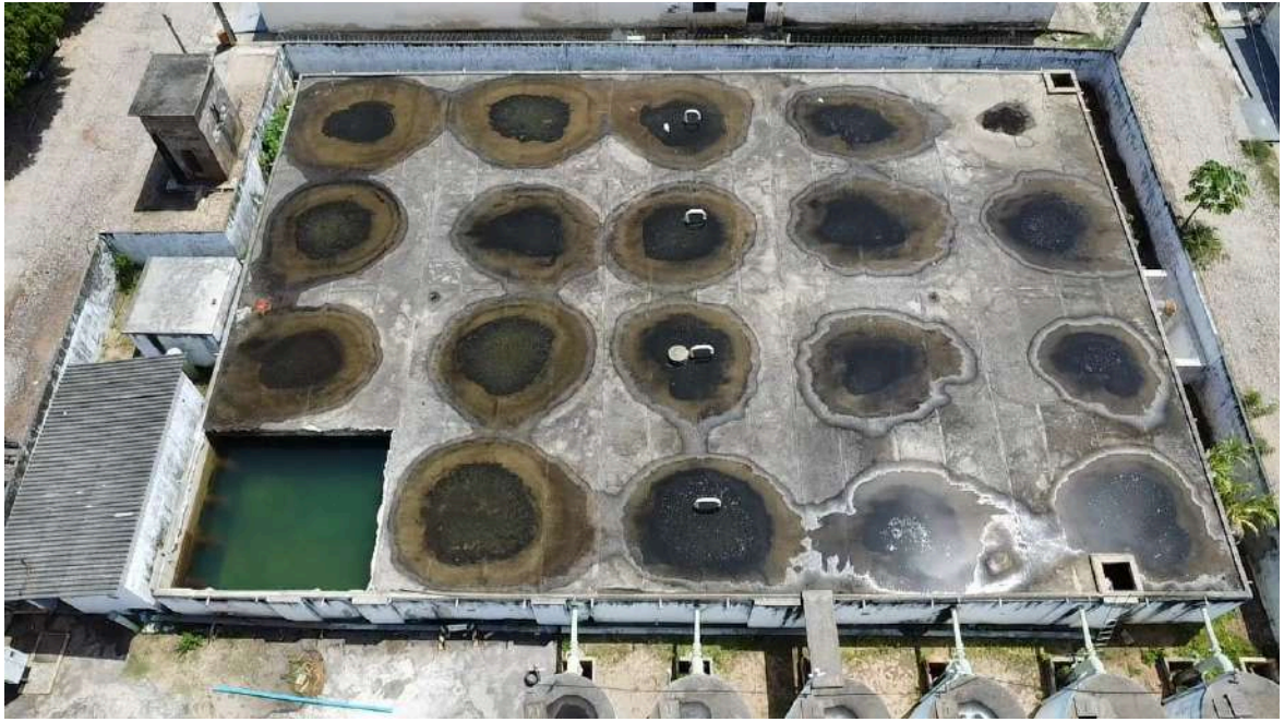
Foto 1 - ETA Cascavel / RAP-01: ausência de identificação e sem tampas, com telhado paliativo na abertura do RAP e com acúmulo de água pluvial.
