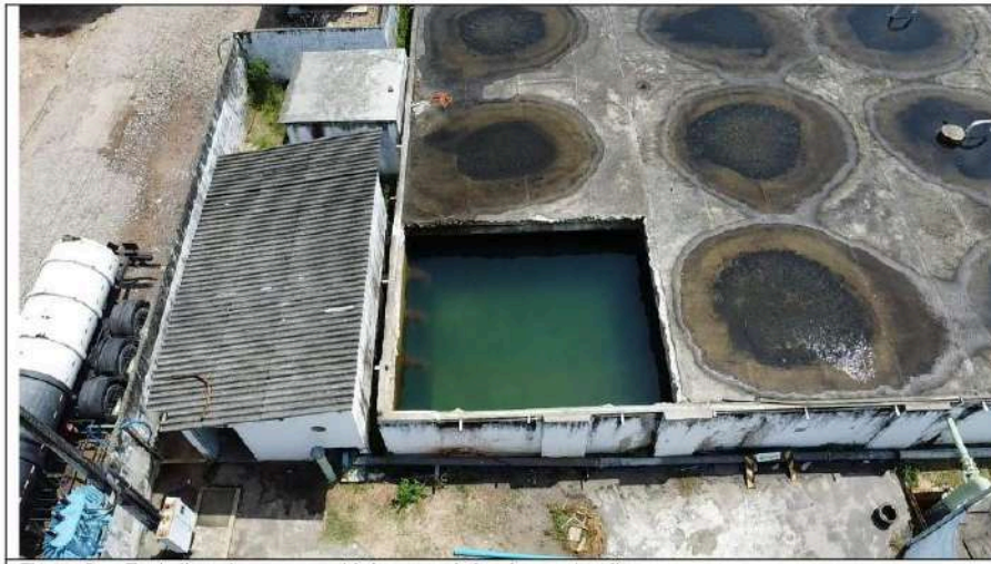
Foto 2 – Detalhe do reservatório sem laje de proteção.
