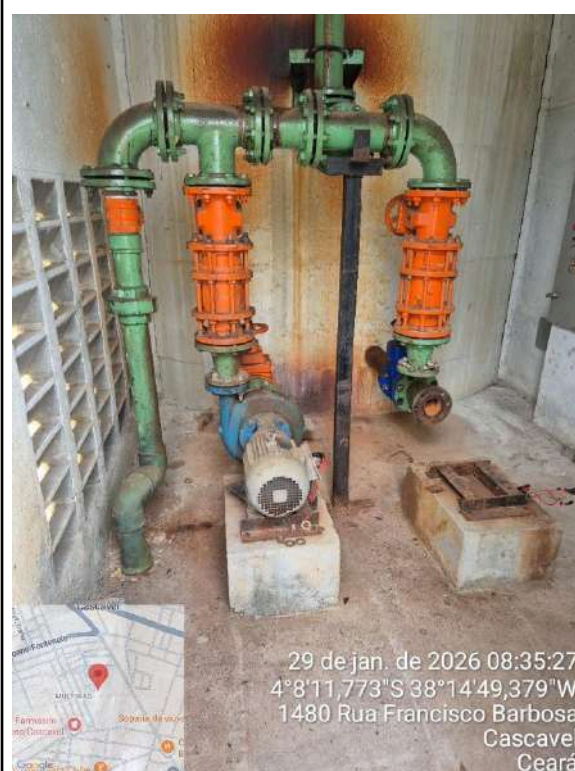
Foto 8 - EEAT-03 (Sede): sem bomba reserva, com peças oxidadas e fiação exposta.
