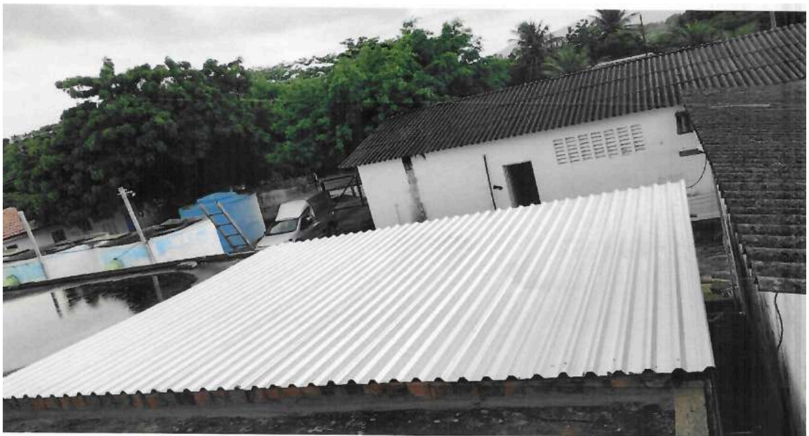
Foto 2 - ETA Cascavel / RAP-01: ausência de identificação e sem tampas, com telhado paliativo na abertura do RAP e com acúmulo de água pluvial.
