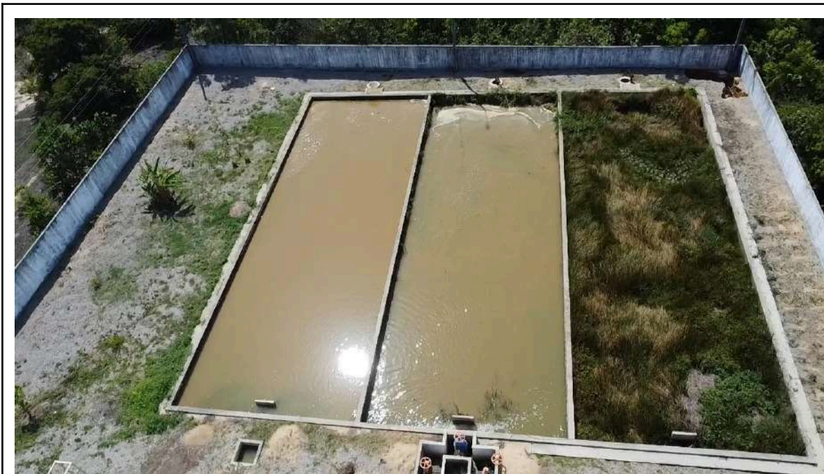
Foto 31 - ETA-02 (Sede): estação de tratamento de rejeitos com acúmulo de vegetação em um dos tanques.
