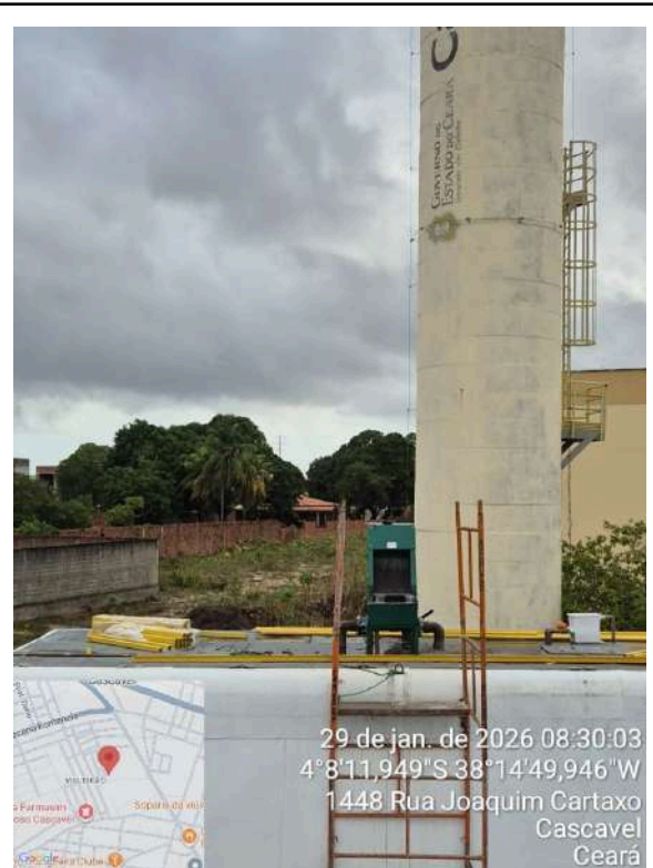
Foto 44 - ETE Cascavel (Sede): Reatores UASB 1 e 2 com vazamento.
