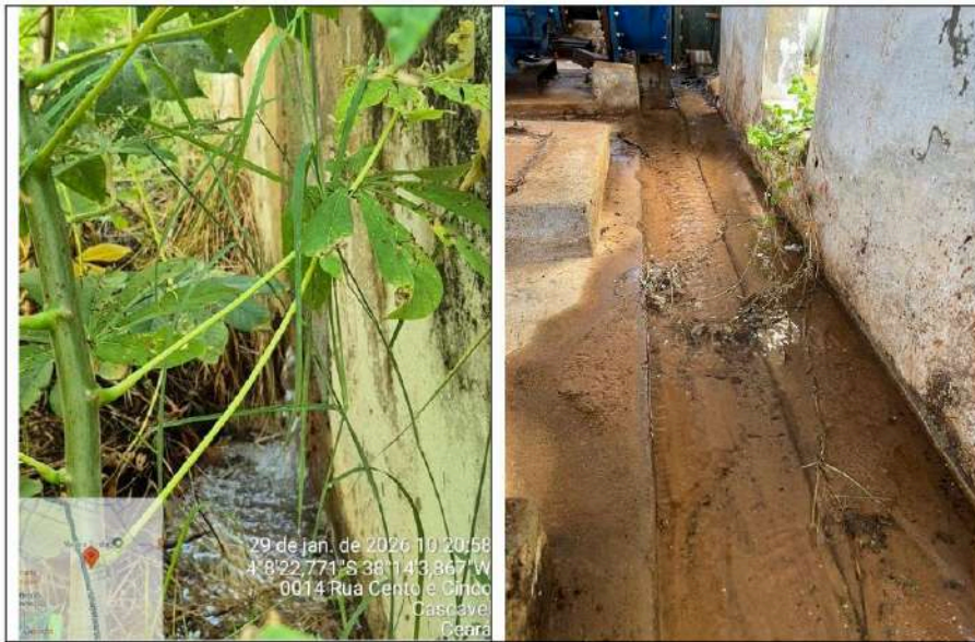
Fotos 3 e 4 – Vazamento de água tratada do reservatório de grande magnitude.
