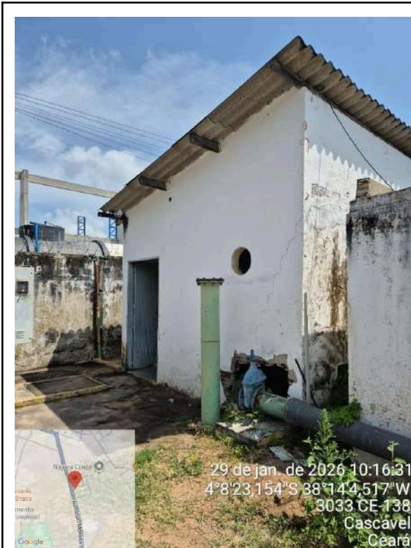
Foto 17 - ETA-01 (Sede): parede da casa de bomba quebrada, com aberturas inadequadas e tinta desgastada.
