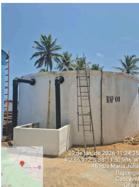
Foto 32 - ETA (Caponga): RAP-01 com escada inadequada.
