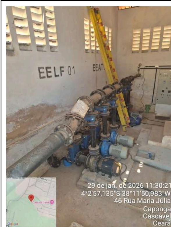
Foto 36 - ETA (Caponga): tubulação das bombas com sujeira e oxidação.
