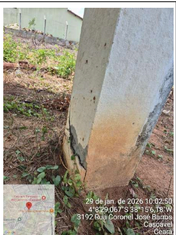
Foto 24 - REL-02 (Sede): base do reservatório com rachaduras.
