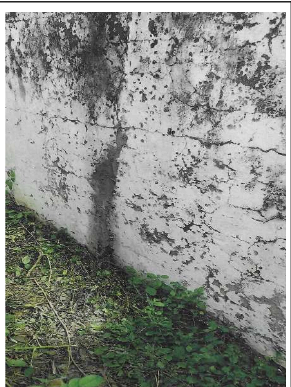
Foto 14 - ETA-01 (Sede): RAP-01 com paredes desgastadas, rachadura reparada paliativamente.
