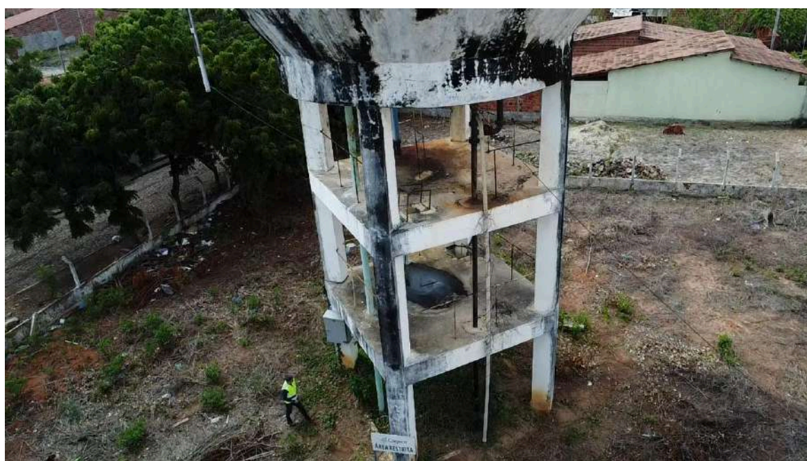
Foto 22 - REL-02 (Sede): escadas e guarda-corpos com oxidação elevada e quebrados.
