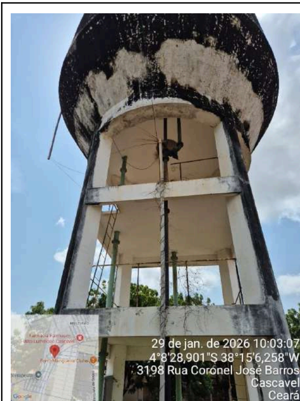
Foto 23 - REL-02 (Sede): pintura desgastada e sujeidade, escadas e guarda-corpos com oxidação elevada e quebrados.
