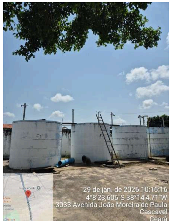
Foto 20 - ETA-01 (Sede): filtros com tinta desgastada e escada inadequada, sem fixação.
