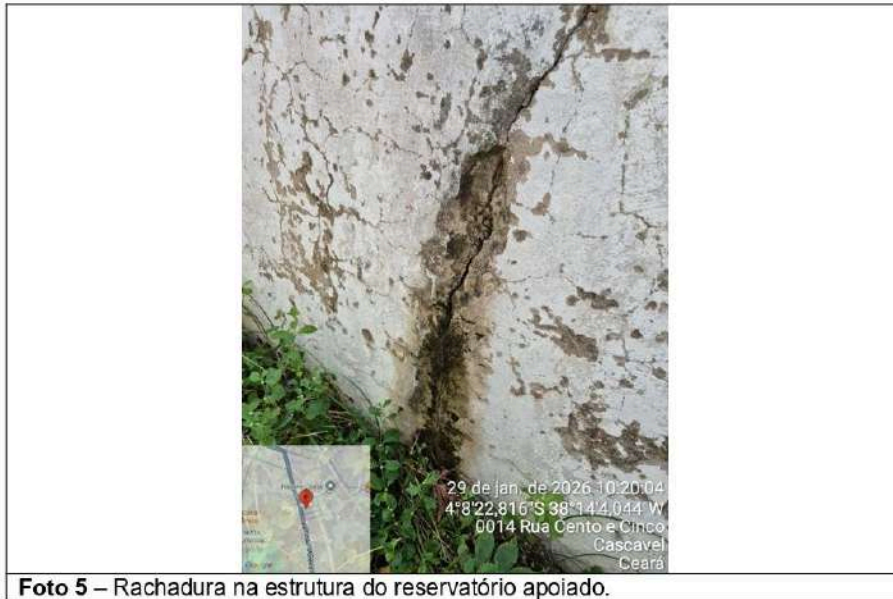
Foto 5 – Rachadura na estrutura do reservatório apoiado.
