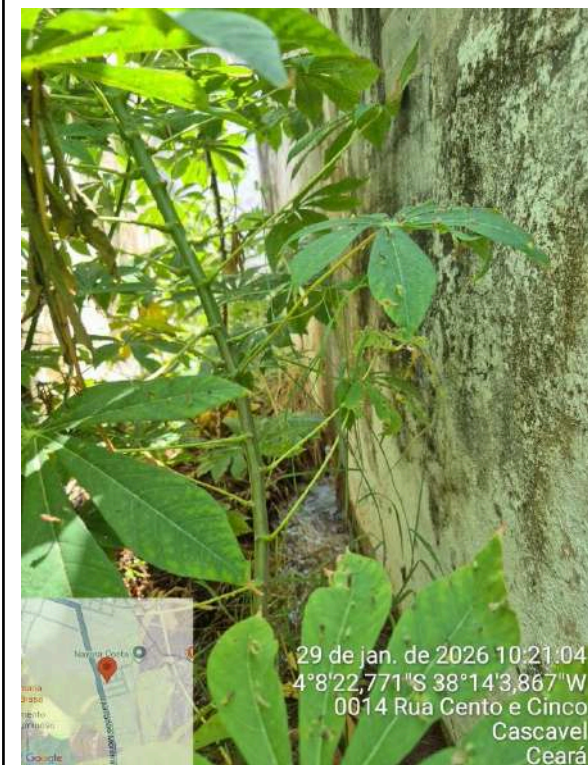
Foto 15 - ETA-01 (Sede): RAP-01 com vazamentos e acúmulo de vegetação ao redor.
