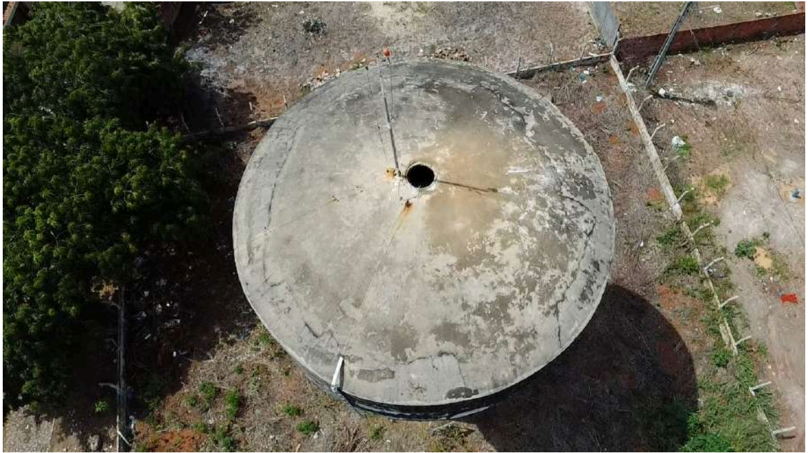
Foto 3 - Cascavel /REL-02: ausência de identificação e sem tampa.
