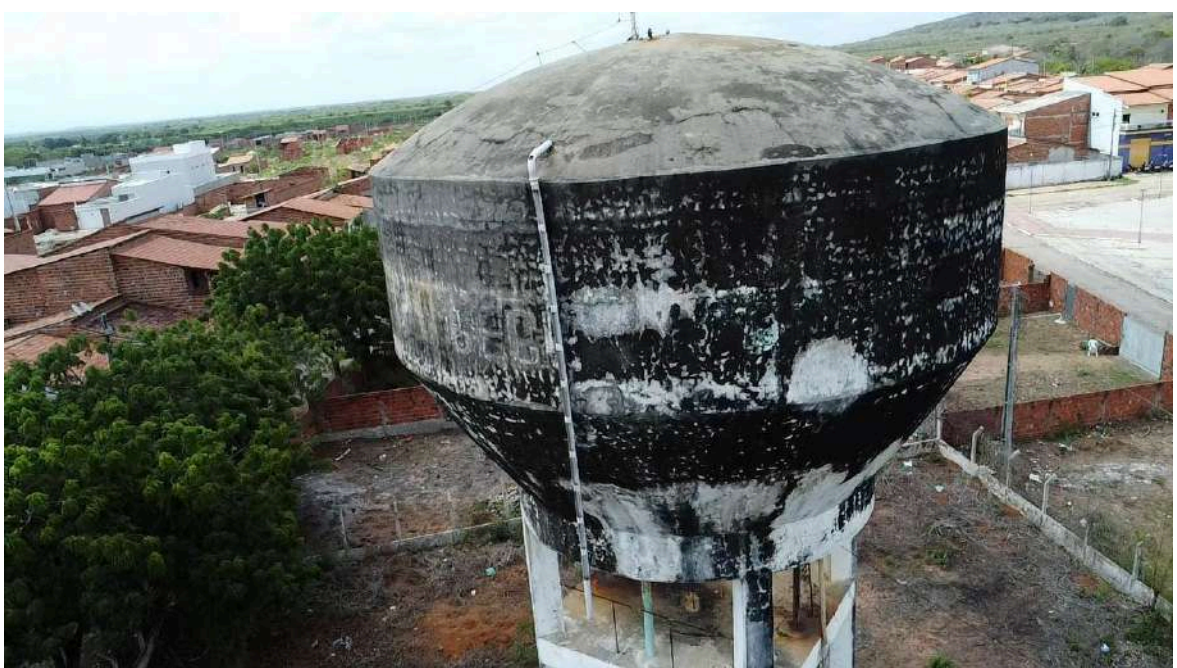
Foto 4 - Cascavel /REL-02: ausência de identificação visível e sem tampa.
