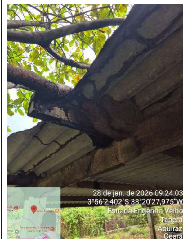
Foto 37 - ETA Riviera (ETRG): presença de cupim.
