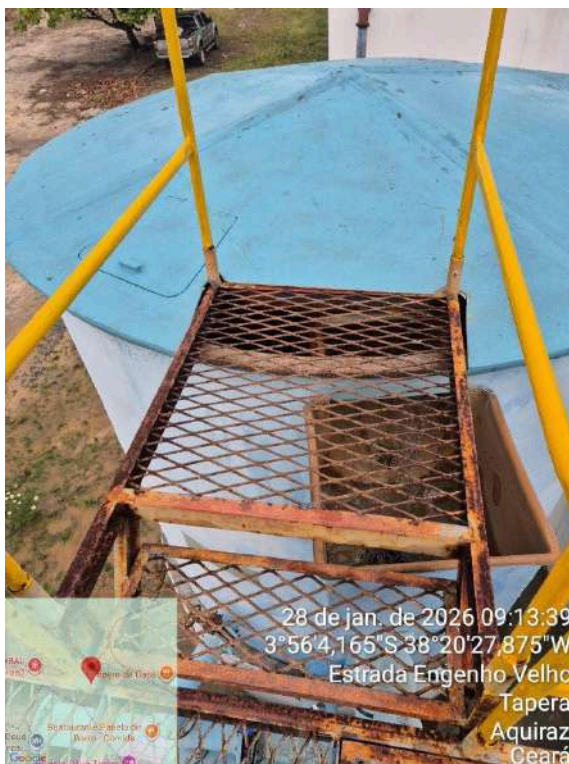
Foto 18 - ETA Riviera (filtros): plataforma oxidada.
