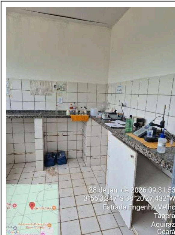
Foto 24 - ETA Riviera (laboratório): pisos com sujidades; armário com porta danificada.
