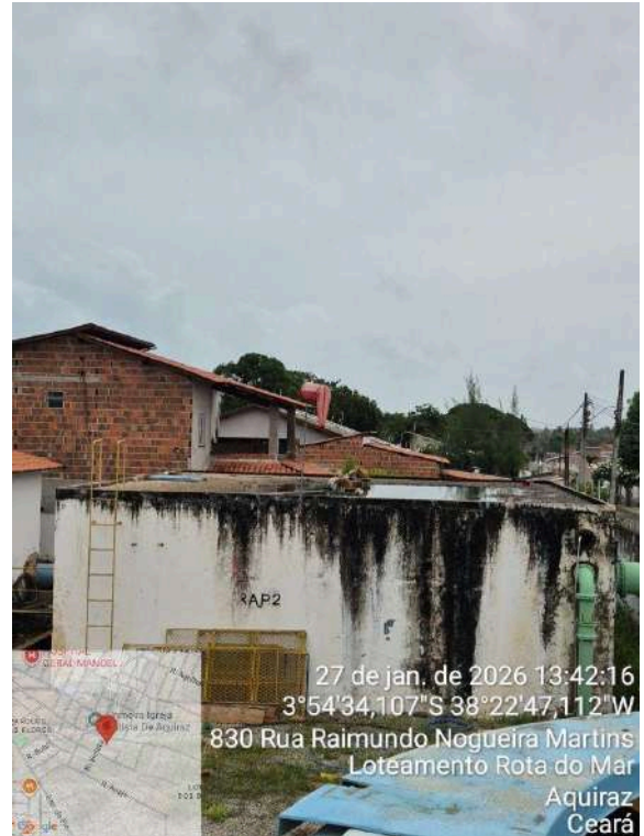
Foto 6 - ETA Aquiraz (RAP-02): pintura desgastada.
