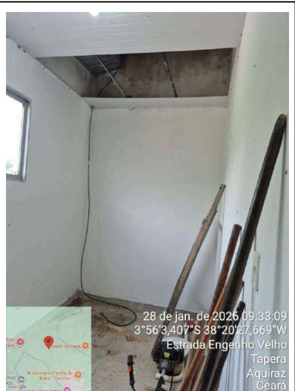
Foto 29 - ETA Riviera (geral): forro incompleto, com abertura no teto e exposição da estrutura superior.
