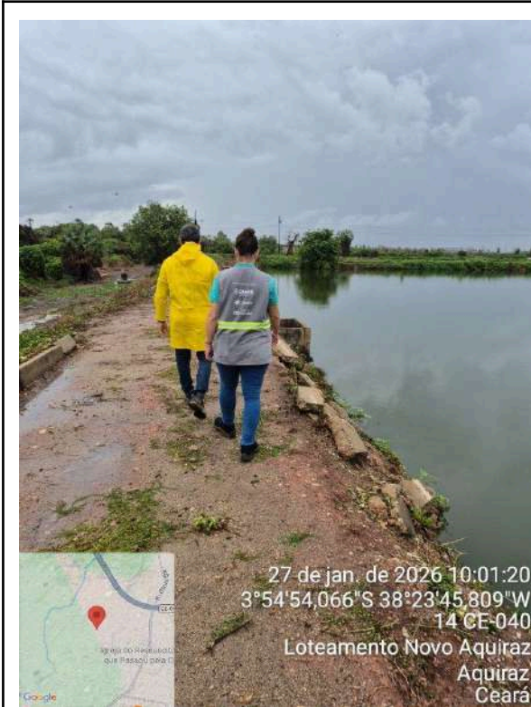
Foto 49 - ETE Aquiraz/Eusébio (lagoa de maturação): placas de concreto danificadas.
