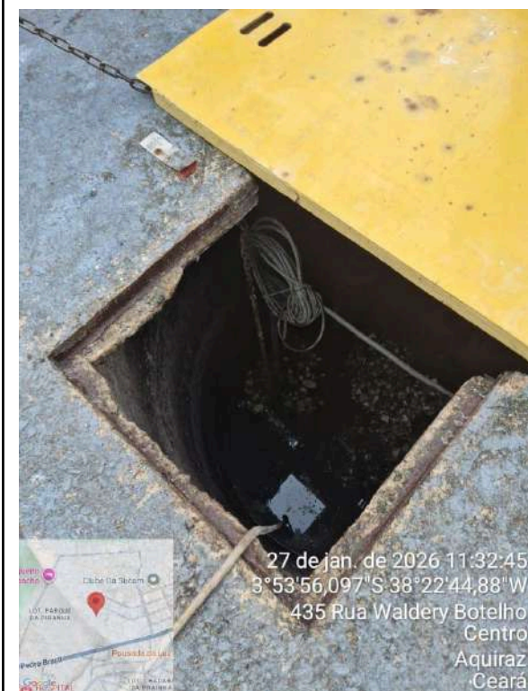
Foto 65 - EEE-02 (Aquiraz III): não possui tratamento preliminar.
