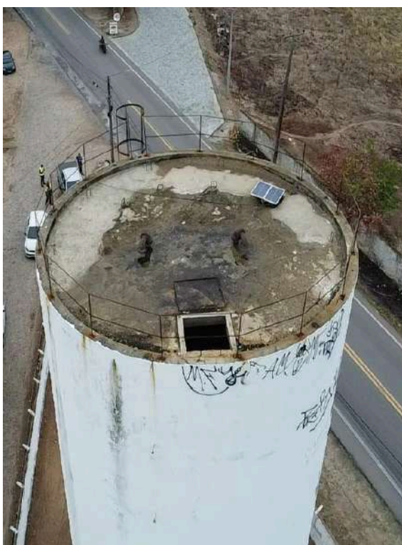
Foto 10 - REL-03 (Sede): ausência de tampa; guarda-corpo oxidado.
