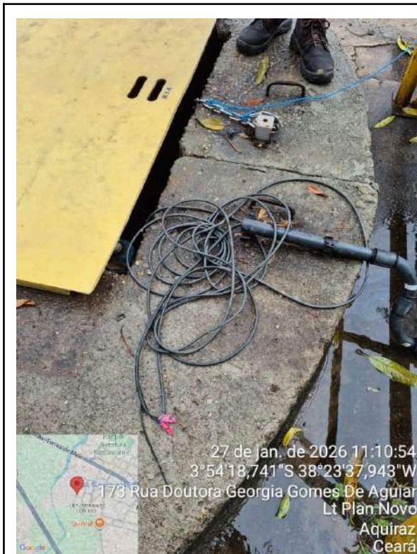
Foto 67 - EEE-03 (Aquiraz IV): fiação inadequada.
