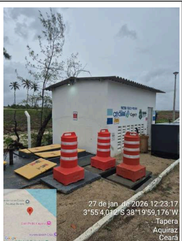
Foto 72 - EEE-32 (Condomínio Aciraz Riviera I): não possui tratamento preliminar.
