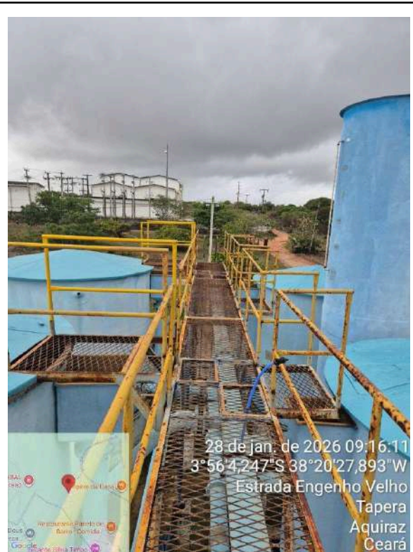
Foto 17 - ETA Riviera (filtros): plataforma oxidada.
