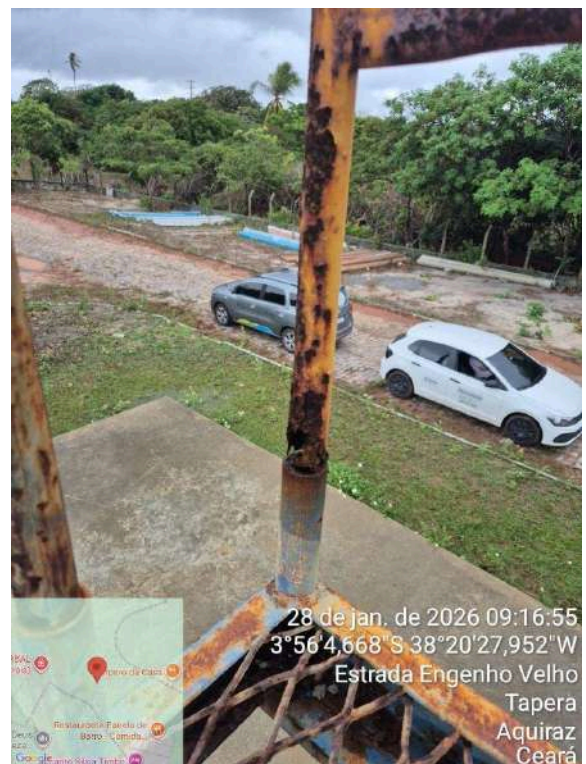
Foto 19 - ETA Riviera (filtros): plataforma oxidada.
