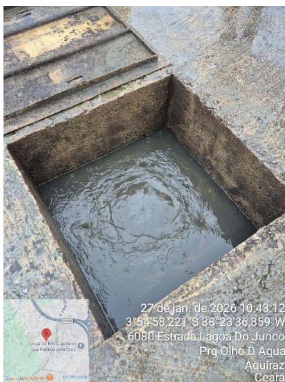
Foto 61 - ETE Riviera (UASB): rosetas entupidas.
