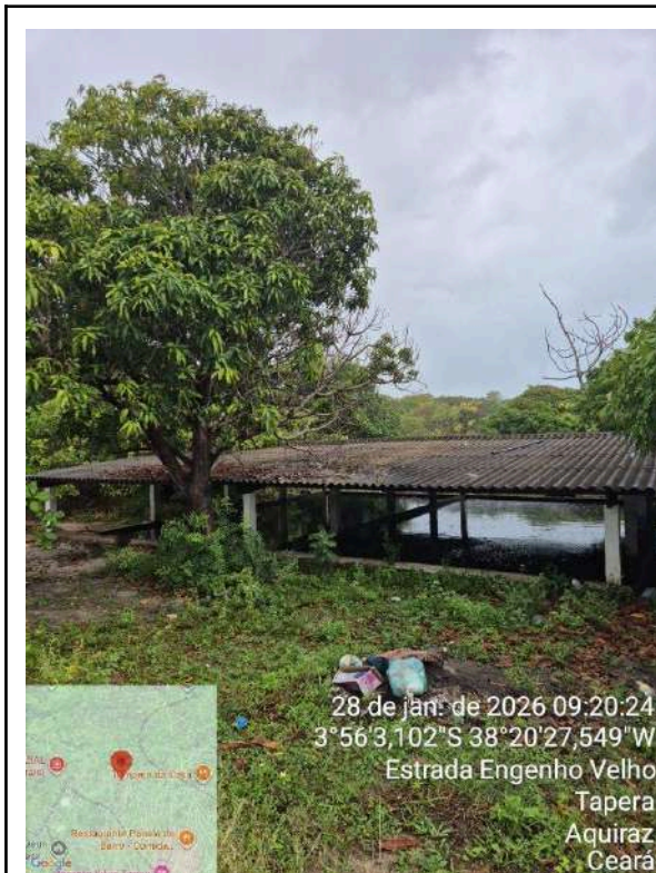
Foto 35 - ETA Riviera (ETRG): presença de vegetação e resíduos no entorno.
