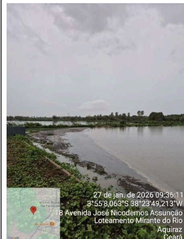
Foto 43 - ETE Aquiraz/Eusébio (lagoa anaeróbia): indícios de zonas mortas; presença de vegetação no entorno.
