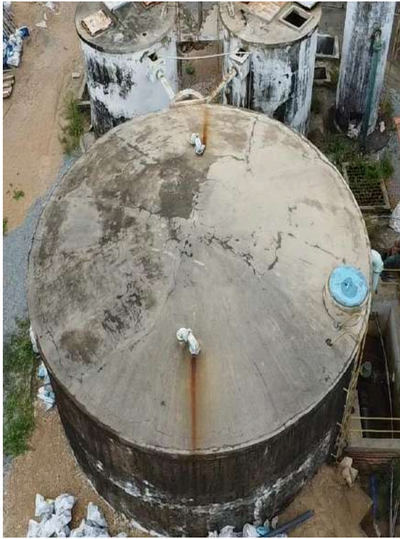
Foto 5 - ETA Aquiraz (RAP-01): presença de rachaduras.
