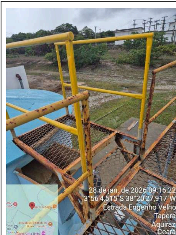
Foto 20- ETA Riviera (filtros): plataforma oxidada.
