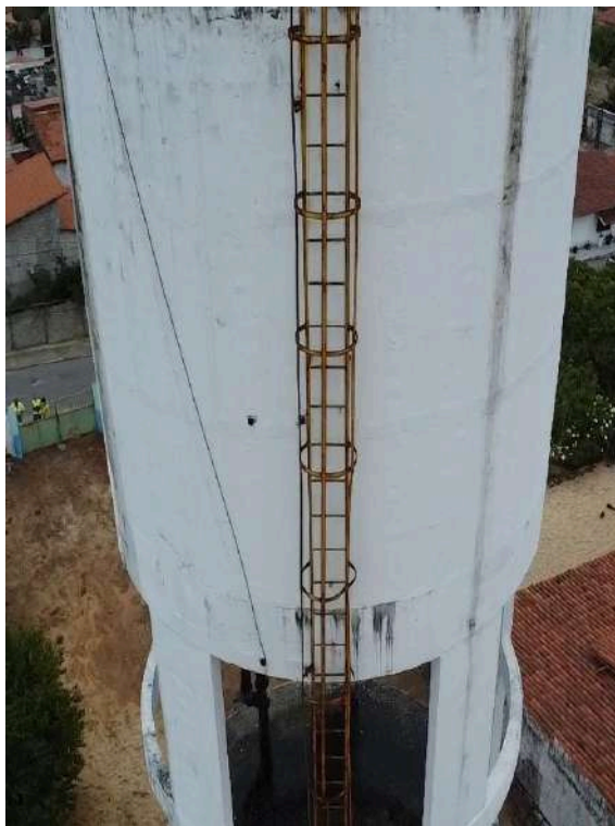
Foto 14 - REL-04 (Prainha): escada oxidada.
