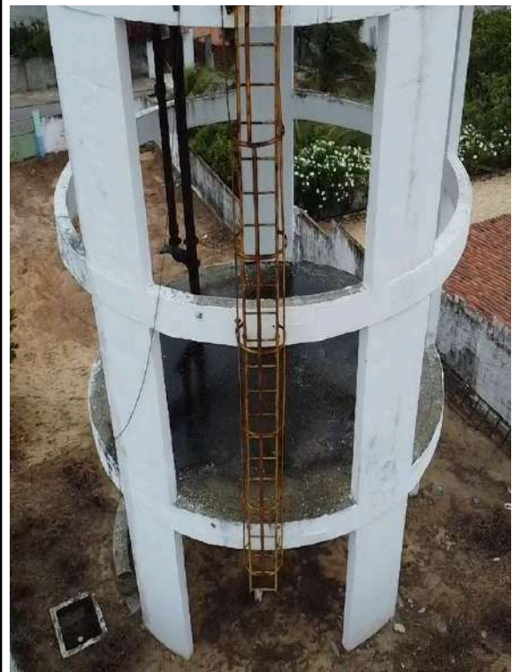
Foto 15 - REL-04 (Prainha): escada oxidada.
