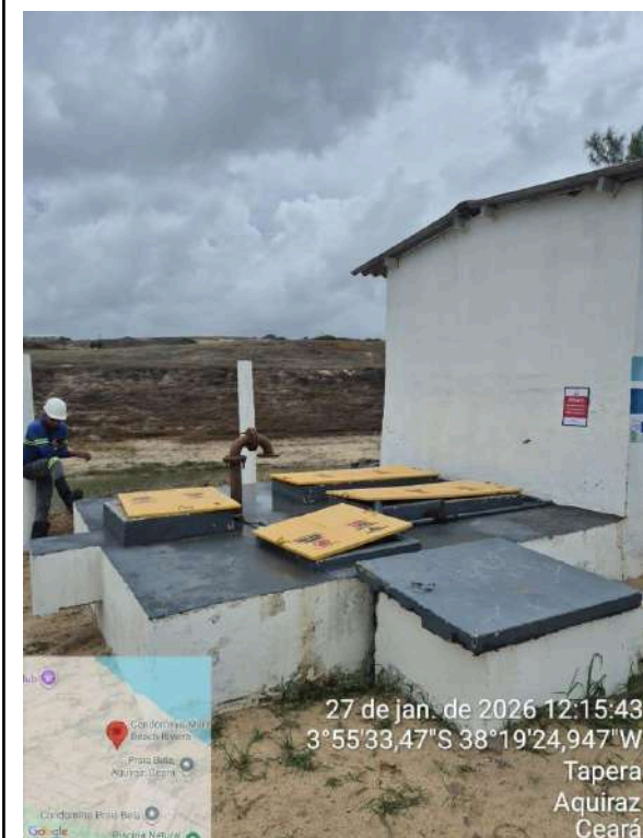
Foto 73 - EEE-33 (Condomínio Aciraz Riviera II): não possui tratamento preliminar.
