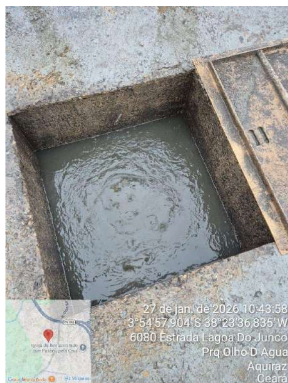
Foto 62 - ETE Riviera (UASB): rosetas entupidas.
