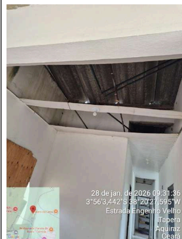
Foto 22 - ETA Riviera (geral): forro incompleto, com abertura no teto e exposição da estrutura superior.
