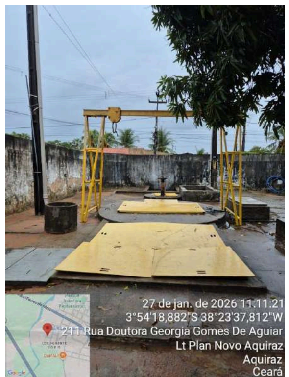
Foto 66 - EEE-03 (Aquiraz IV): não possui tratamento preliminar.
