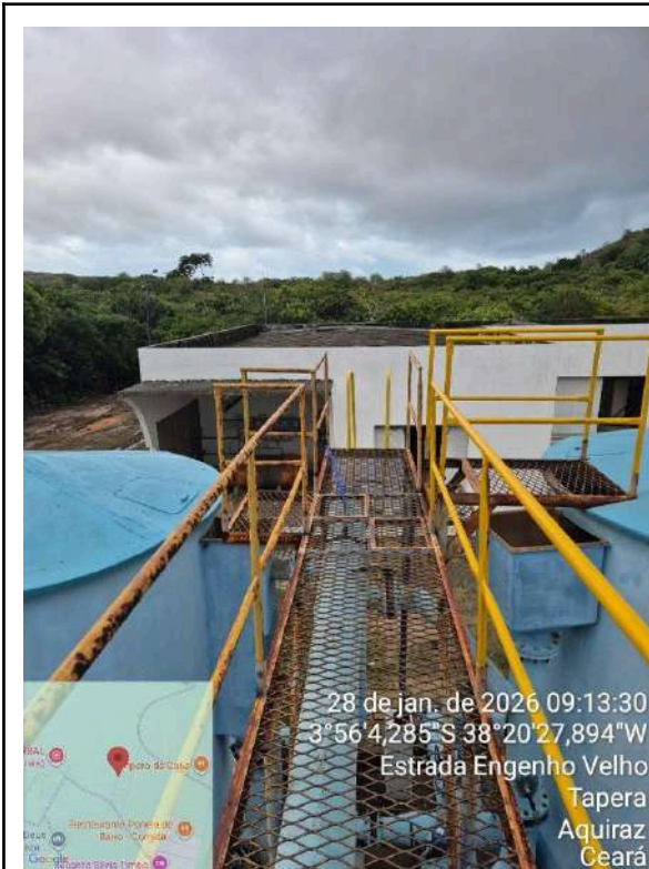
Foto 16 - ETA Riviera (filtros): plataforma oxidada.
