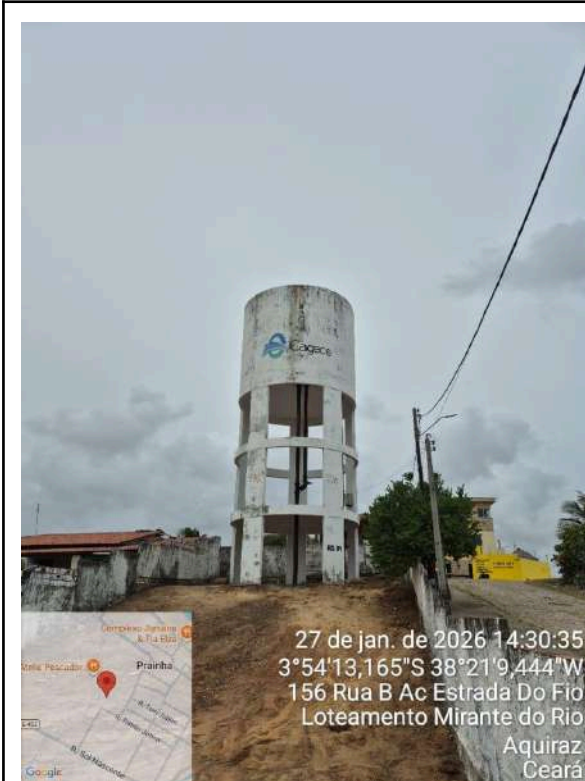
Foto 12 - REL-04 (Sede): pintura desgastada.
