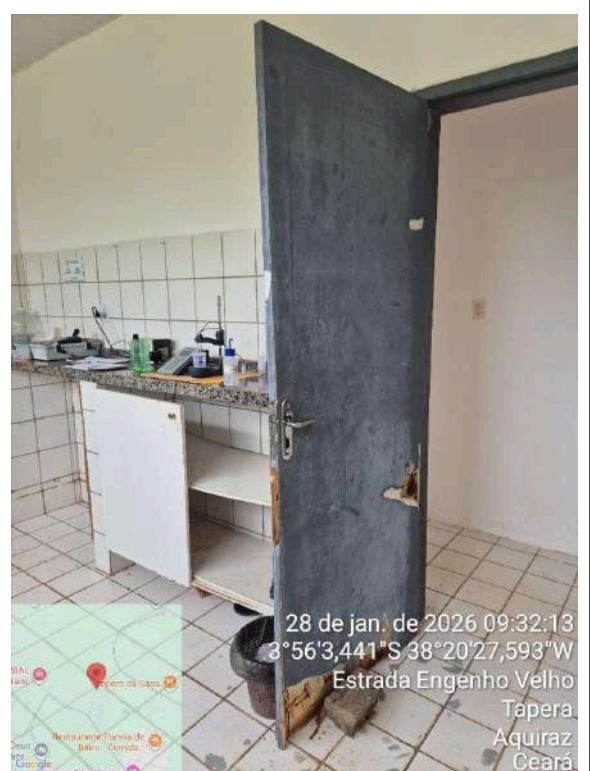
Foto 23 - ETA Riviera (laboratório): porta danificada.
