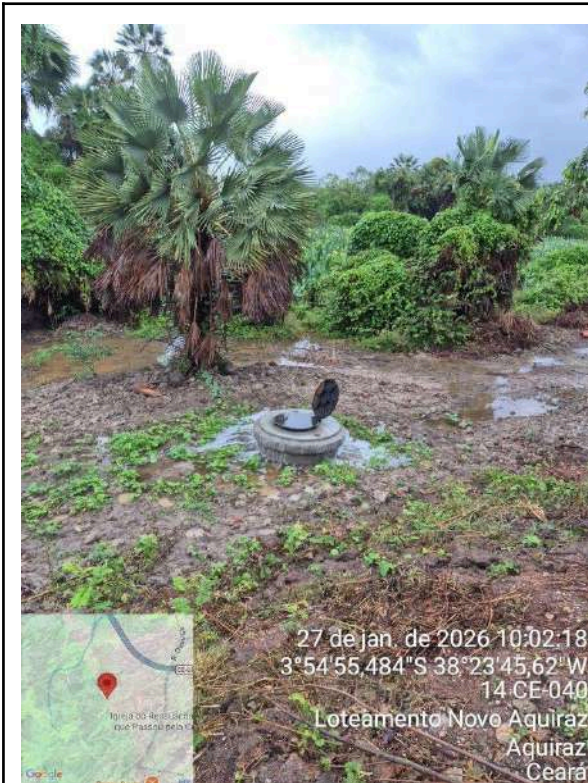
Foto 53 - ETE Aquiraz/Eusébio: extravasamento de esgoto.
