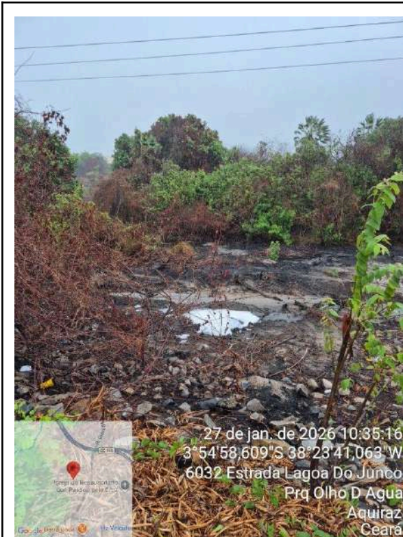
Foto 63 - ETE Riviera: extravasamento de esgoto.
