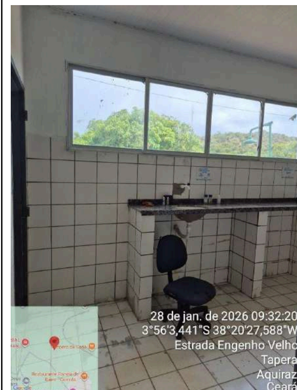
Foto 26 - ETA Riviera (laboratório): pisos com sujidades.
