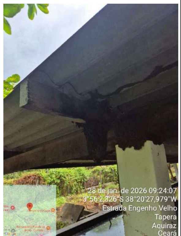
Foto 38 - ETA Riviera (ETRG): presença de cupim.
