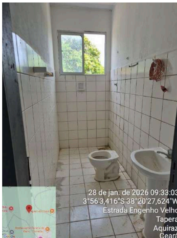
Foto 30 - ETA Riviera (banheiro): banheiro em condições inadequadas de uso.
