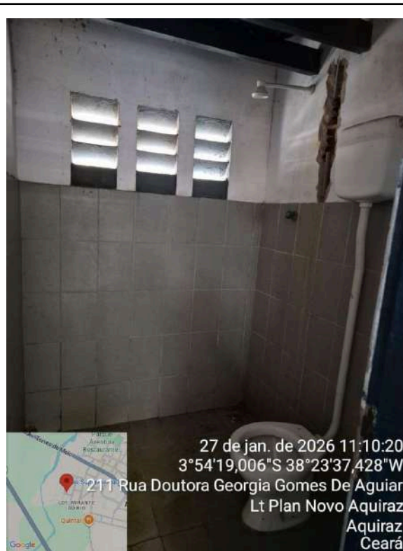
Foto 68 - EEE-03 (Aquiraz IV): banheiro impróprio para uso.
