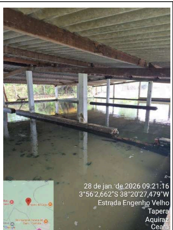
Foto 36 - ETA Riviera (ETRG): estrutura inoperante, funcionando apenas como leito de secagem.
