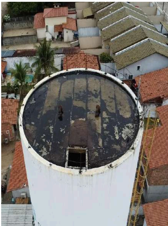
Foto 7 - ETA Aquiraz (REL-02): ausência de tampa; guarda-corpo oxidado.
