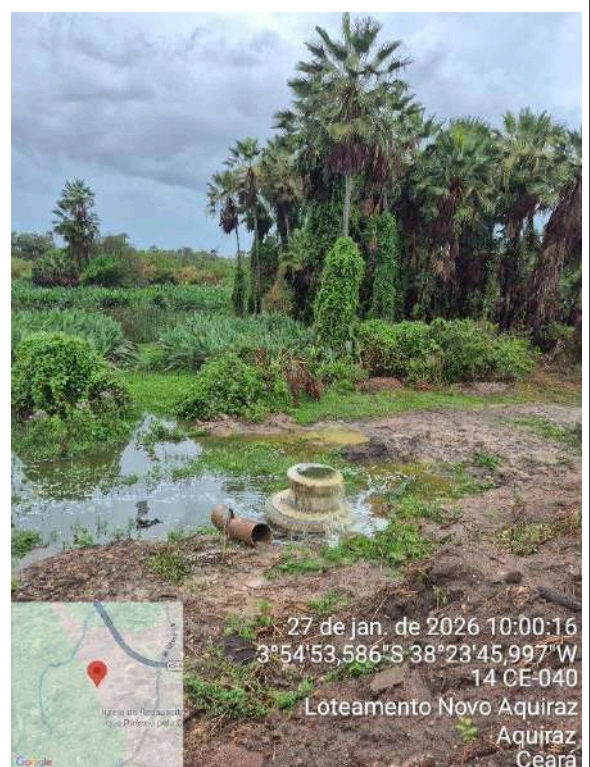
Foto 52 - ETE Aquiraz/Eusébio: extravasamento de esgoto.
