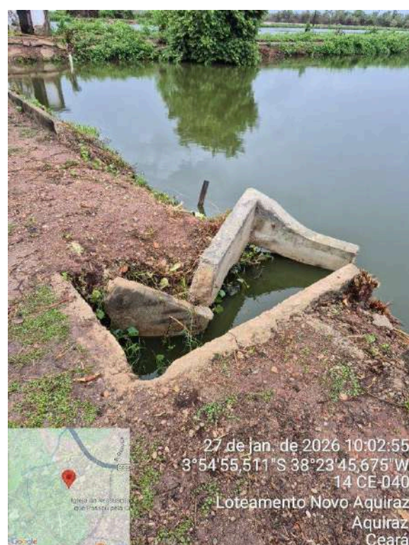
Foto 48 - ETE Aquiraz/Eusébio (lagoa de maturação): caixa danificada; ausência de placas de concreto.
