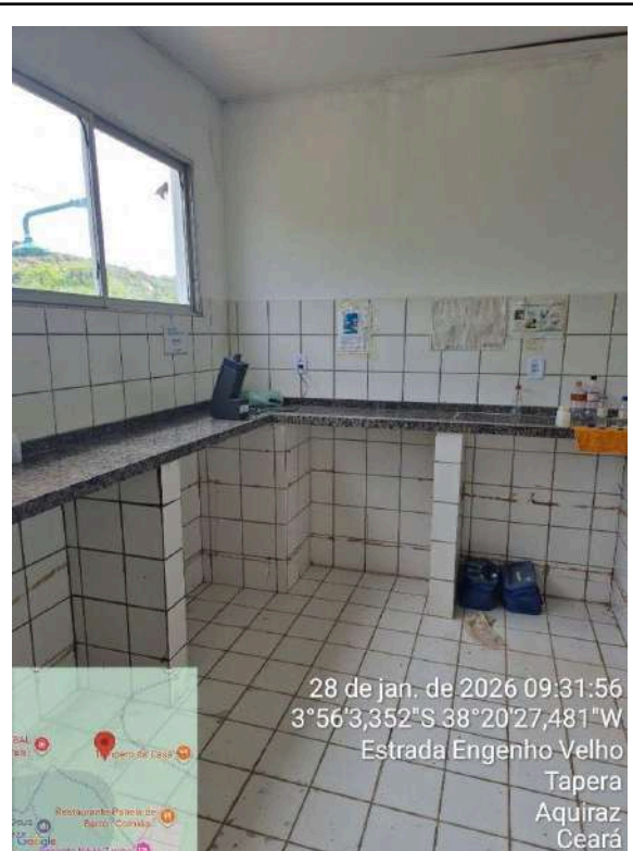
Foto 25 - ETA Riviera (laboratório): pisos com sujidades.
