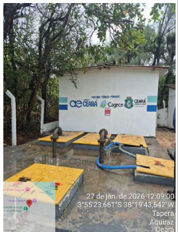
Foto 74 - EEE-34 (Condomínio Aciraz Riviera II): não possui tratamento preliminar.
