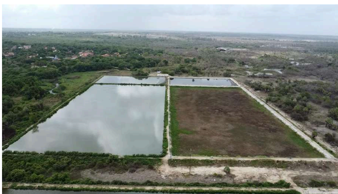
Foto 57 - ETE Aquiraz/Eusébio (lagoa facultativa): lagoa inoperante.
