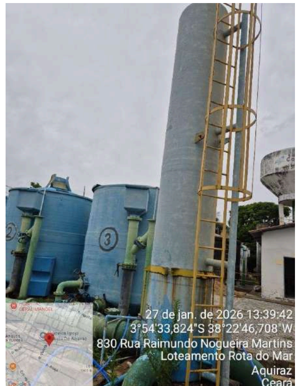
Foto 8 - ETA Aquiraz (torre de nível): escada oxidado.
