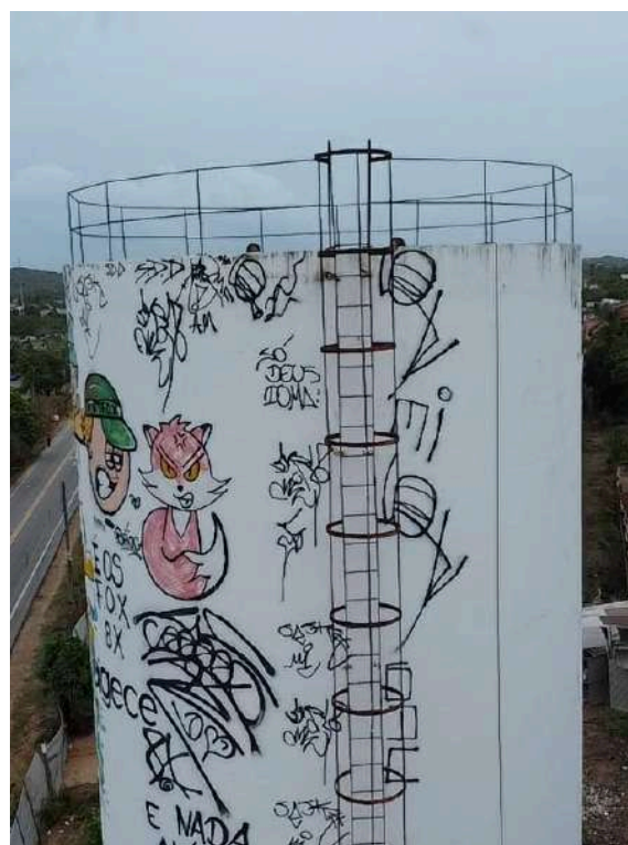
Foto 11 - REL-03 (Sede): escada oxidada.
