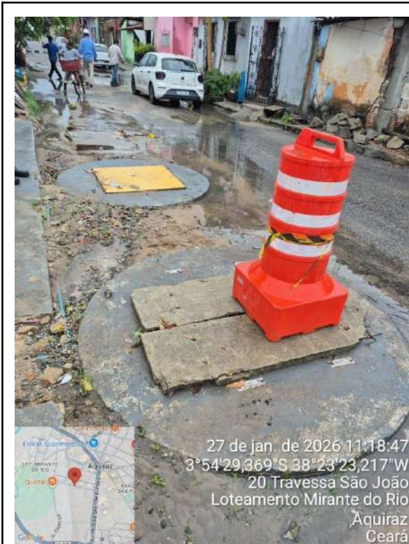
Foto 71 - EEE-04 (Aciraz V): não possui tratamento preliminar; poços localizados na via.
