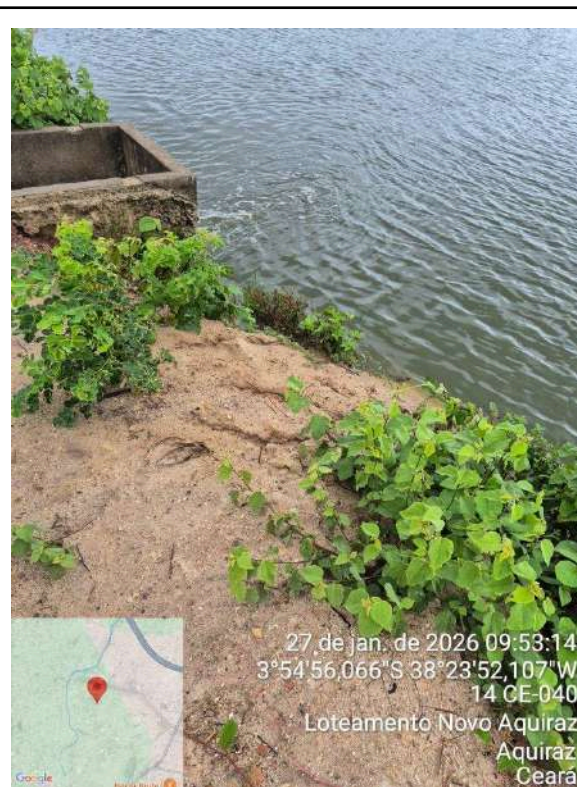
Foto 46 - ETE Aquiraz/Eusébio (lagoa de maturação): ausência de placas de concreto; presença de vegetação no entorno.
