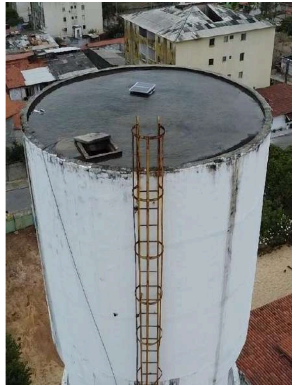
Foto 13 - REL-04 (Prainha): tampa deslocada; ausência de guarda-corpo; escada oxidada.
