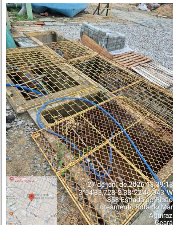
Foto 3 - ETA Aciraz (geral): grades de proteção oxidadas; grade de proteção incompleta.
