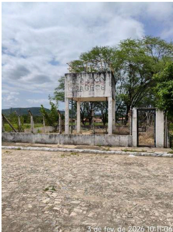
Foto 55 - REL-03 (Taboleiro dos Mendes): infraestrutura desativada apresentando anomalias.
