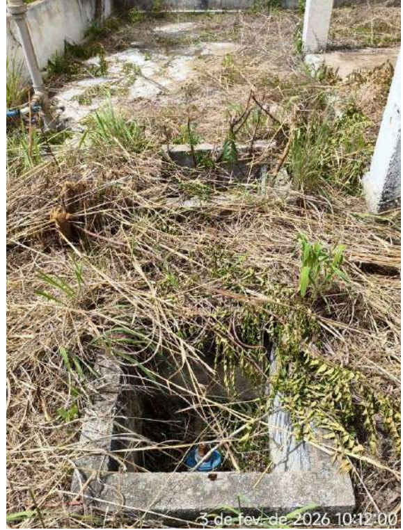
Foto 58 - REL-03 (Taboleiro dos Mendes): infraestrutura desativada, apresentando anomalias (caixas sem tampas).
