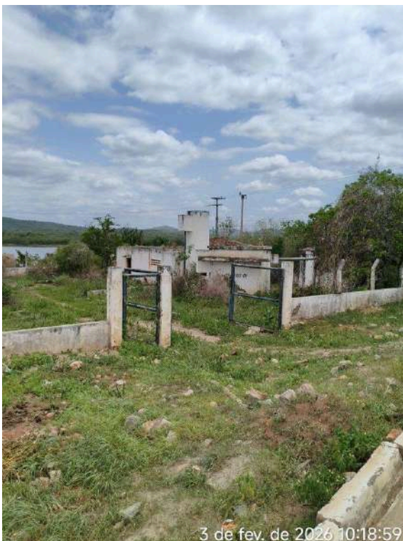
Foto 38 - ETA-01 - Taboleiro dos Mendes: unidade desativada em estado de abandono total, acesso livre pelo portão aberto ou mureta/cerca danificada.
