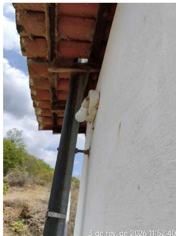
Foto 26 - Casa dos Quadros de Comando (EECS-02): ausência de iluminação funcional (externa).
