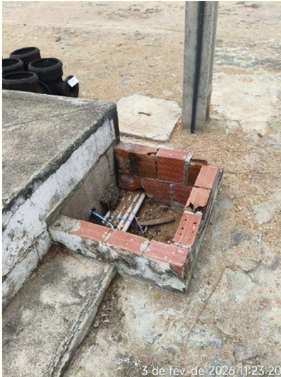
Foto 9 - caixa de proteção e inspeção sem tampa.
