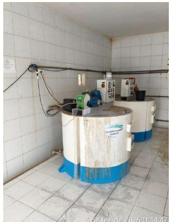
Foto 16 - Estação de Cloro / Casa de Química: fios / cabos instalados sem eletrodutos de proteção e isolamento.
