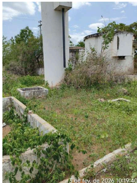
Foto 39 - ETA-01 - Taboleiro dos Mendes: unidade desativada em estado de abandono total, tomada pela vegetação e caixas sem tampas.
