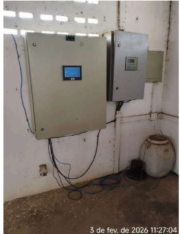
Foto 14 - Casa de bombas: fios / cabos instalados através de cobogós e sem eletrodutos de proteção e isolamento.
