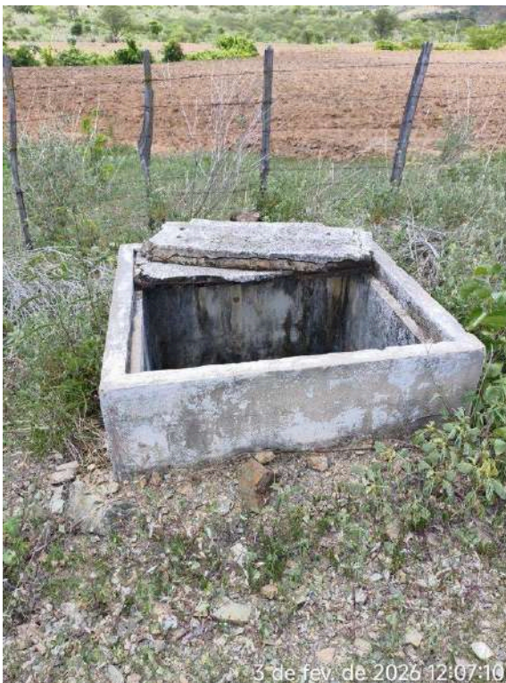
Foto 28 - Caixas de descarga e ventosas: com tampas quebradas ou ausentes ao longo da linha da adutora.
