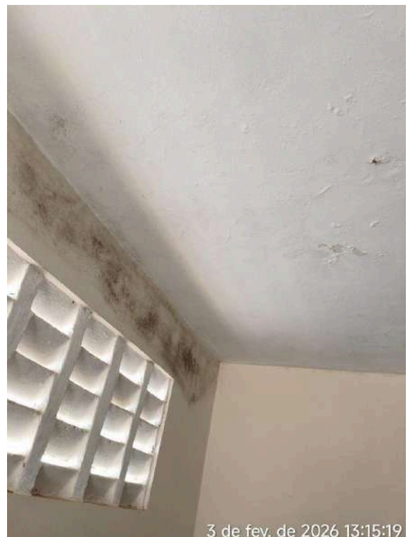
Foto 64 - Escritório Operacional: apresenta manchas de infiltração / vazamento no teto e pintura deteriorada.
