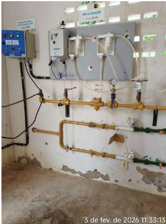
Foto 45 - Estação de Cloro / Casa de Química: reboco e pintura deteriorados e pisos danificados.
