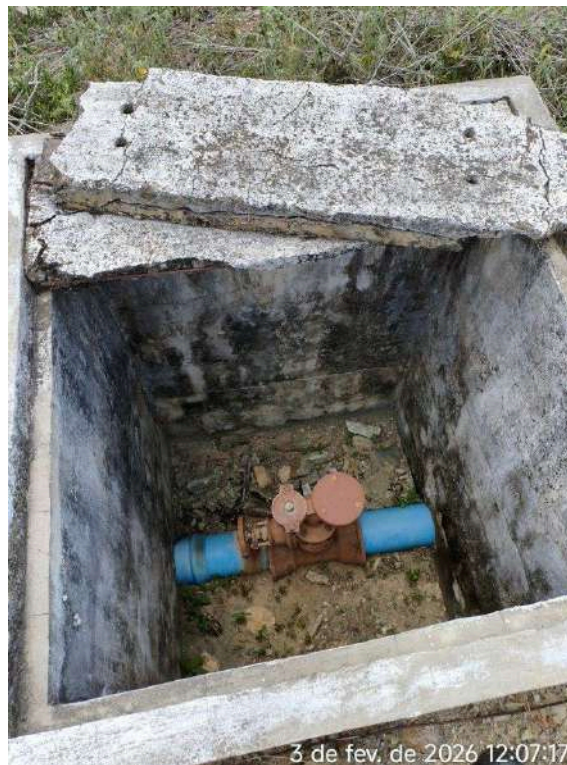
Foto 29 - Caixas de descarga e ventosas: com tampas quebradas ou ausentes ao longo da linha da adutora.
