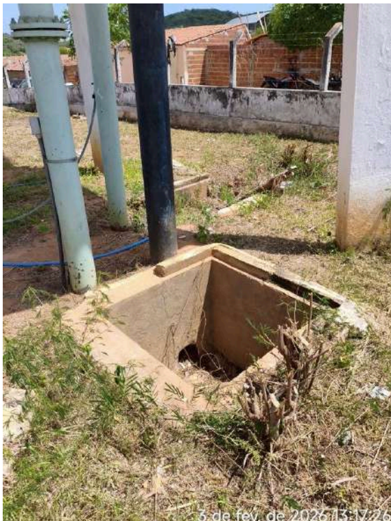
Foto 23 - Escritório: caixas de proteção e inspeção danificadas e sem tampa/grade.
