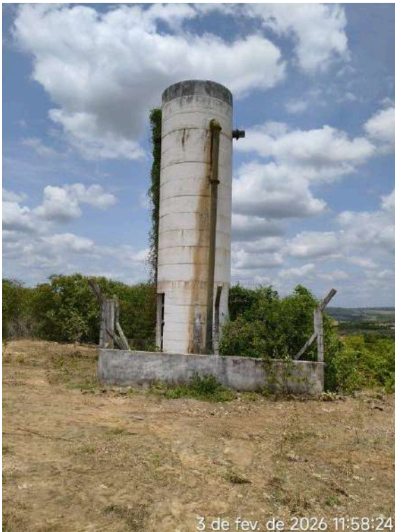
Foto 36 - Torre de Equilíbrio 02: apresenta crescimento excessivo de vegetação e pintura deteriorada.
