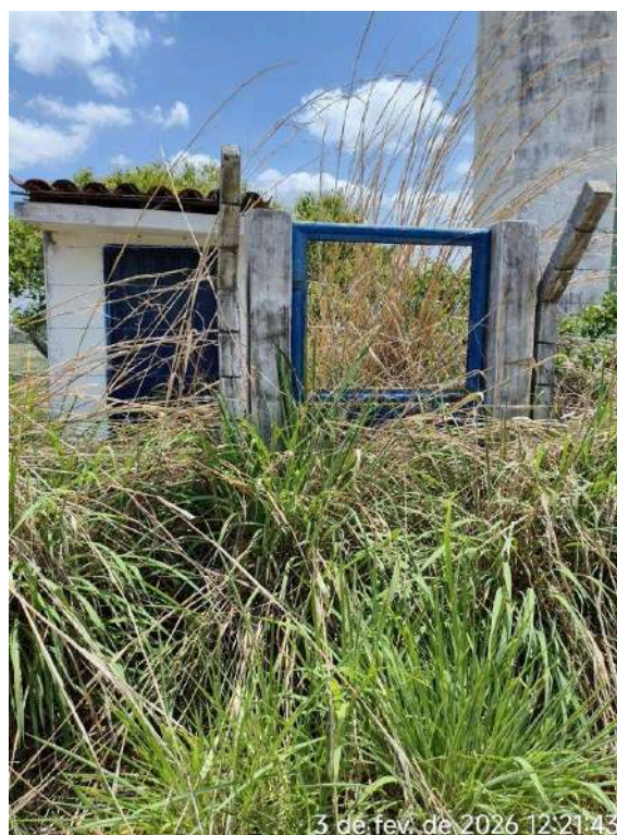
Foto 31 - Torre de Amortecimento (TAU-01): a infraestrutura inacessível tomada pela vegetação e problema na tranca do portão.
