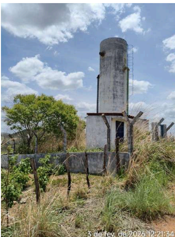
Foto 30 - Torre de Amortecimento (TAU-01): a infraestrutura inacessível tomada pela vegetação e apresenta pintura e identificação deterioradas.
