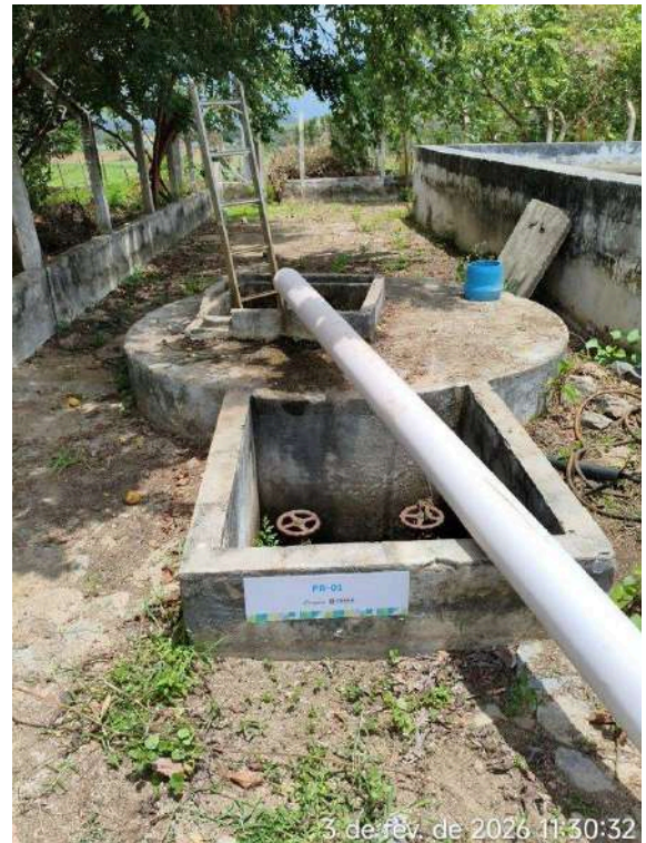
Foto 18 - ETRG: poço de reunião de água de recuperação sem tampa/grade de proteção da abertura de inspeção.
