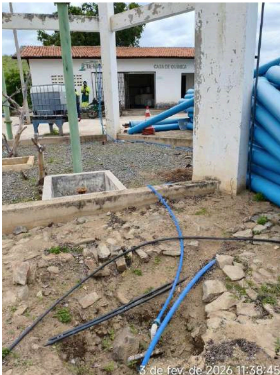
Foto 11 - caixa de proteção e inspeção sem tampa e tubulação exposta por sobre o solo da área de circulação do pátio.
