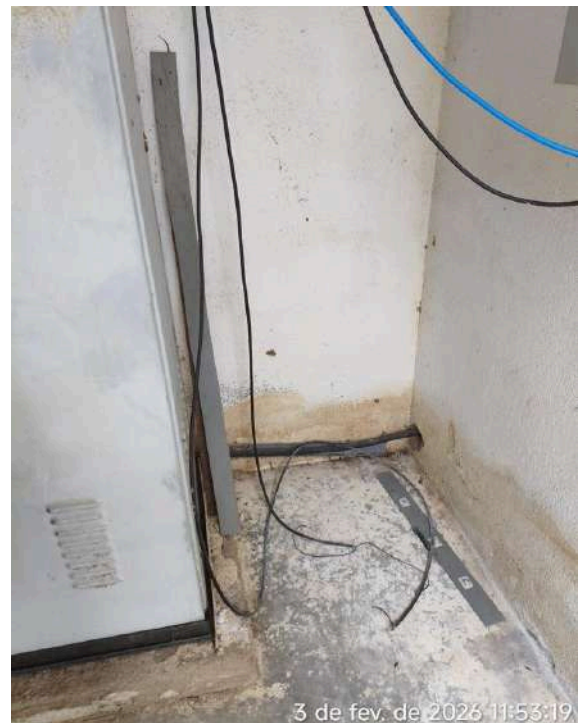
Foto 4 - Casa dos Quadros de Comando: fios / cabos sem eletroduto de proteção e isolamento com pontas soltas sobre o piso.
