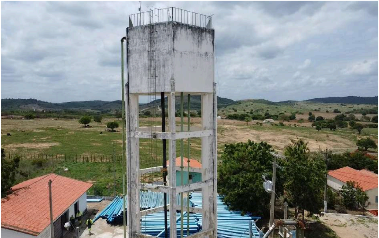
Foto 43 - ETA-02 - Mamoeiro: pintura e identificação das infra estruturas deterioradas (REL-04).
