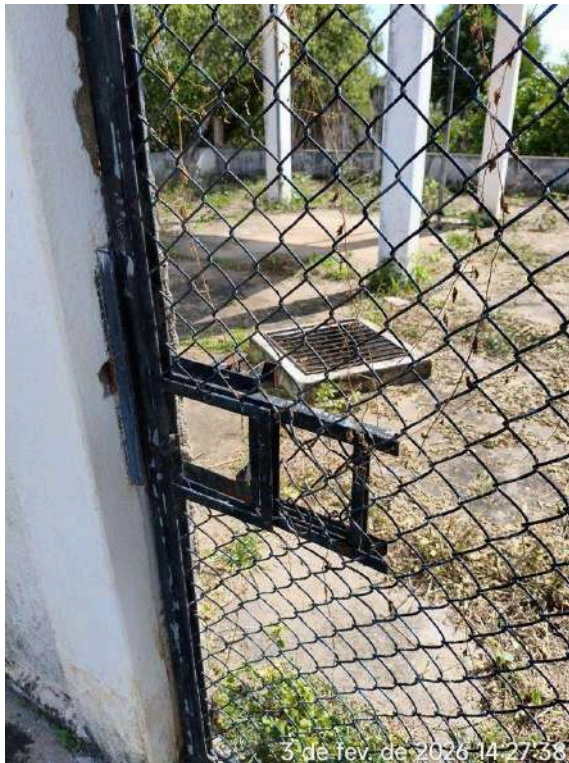
Foto 53 - REL-02 (Vila Mariana): o portão está sem tranca.
