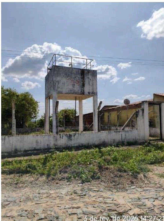
Foto 19 - REL-02 (Vila Mariana): não possui escada de acesso.
