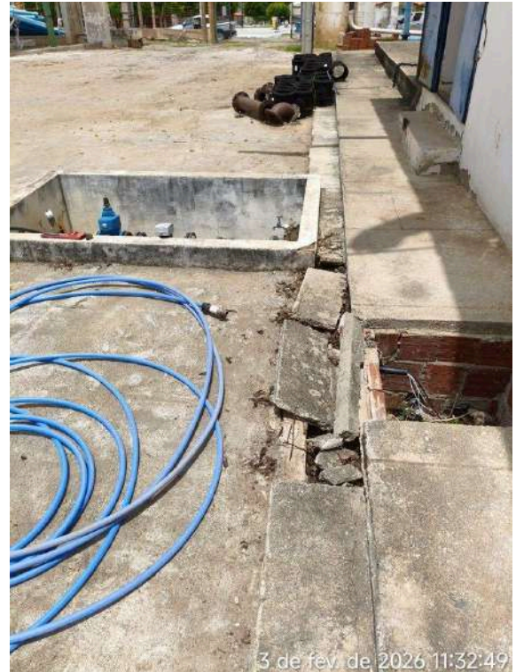
Foto 10 - caixas de proteção e inspeção sem tampa.
