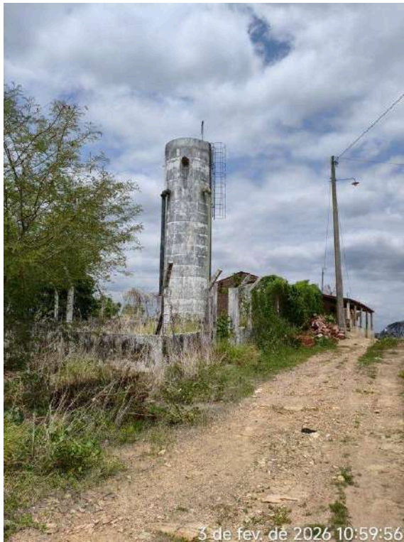
Foto 32 - Torre de Amortecimento (TAU-02): infraestrutura com pintura e identificação deterioradas.
