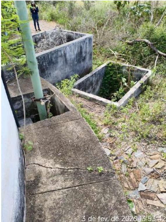
Foto 21 - RAP-04: caixas de proteção e inspeção sem tampa/grade.
