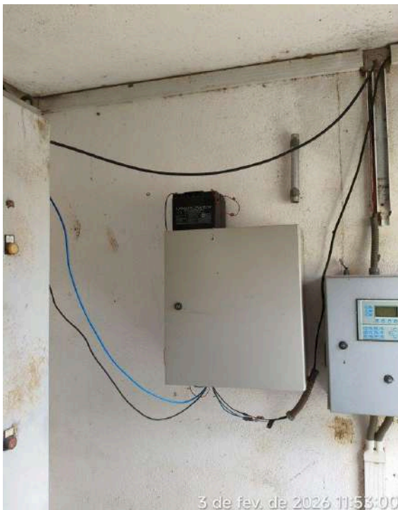
Foto 3 - Casa dos Quadros de Comando: fios / cabos sem eletroduto de proteção e isolamento.
