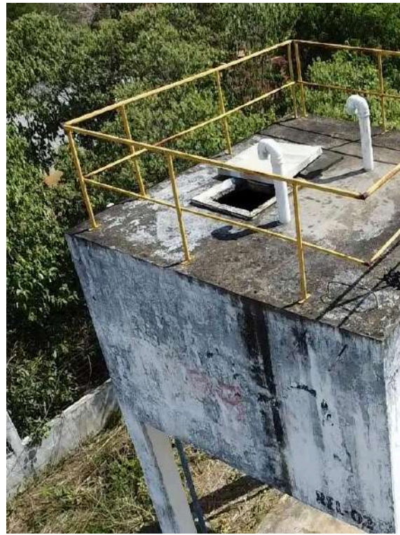
Foto 54 - REL-02 (Vila Mariana): pintura deteriorada e a tampa da entrada de inspeção está aberta.
