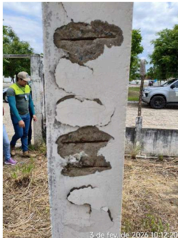
Foto 56 - REL-03 (Taboleiro dos Mendes): infraestrutura desativada, apresentando anomalias (concreto deteriorado e ferragem aparente).
