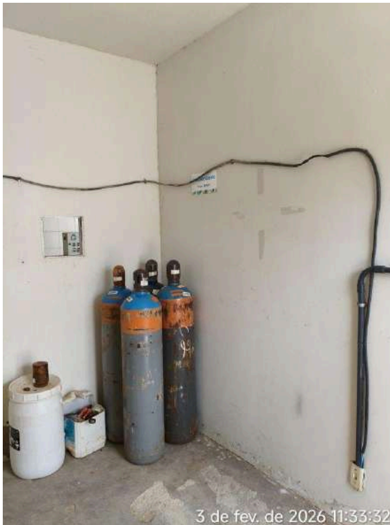
Foto 17 - Estação de Cloro / Casa de Química: fios / cabos instalados sem eletrodutos de proteção e isolamento.
