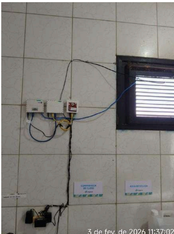
Foto 15 - Estação de Cloro / Casa de Química: fios / cabos instalados através de venezianas de janela e sem eletrodutos de proteção e isolamento.
