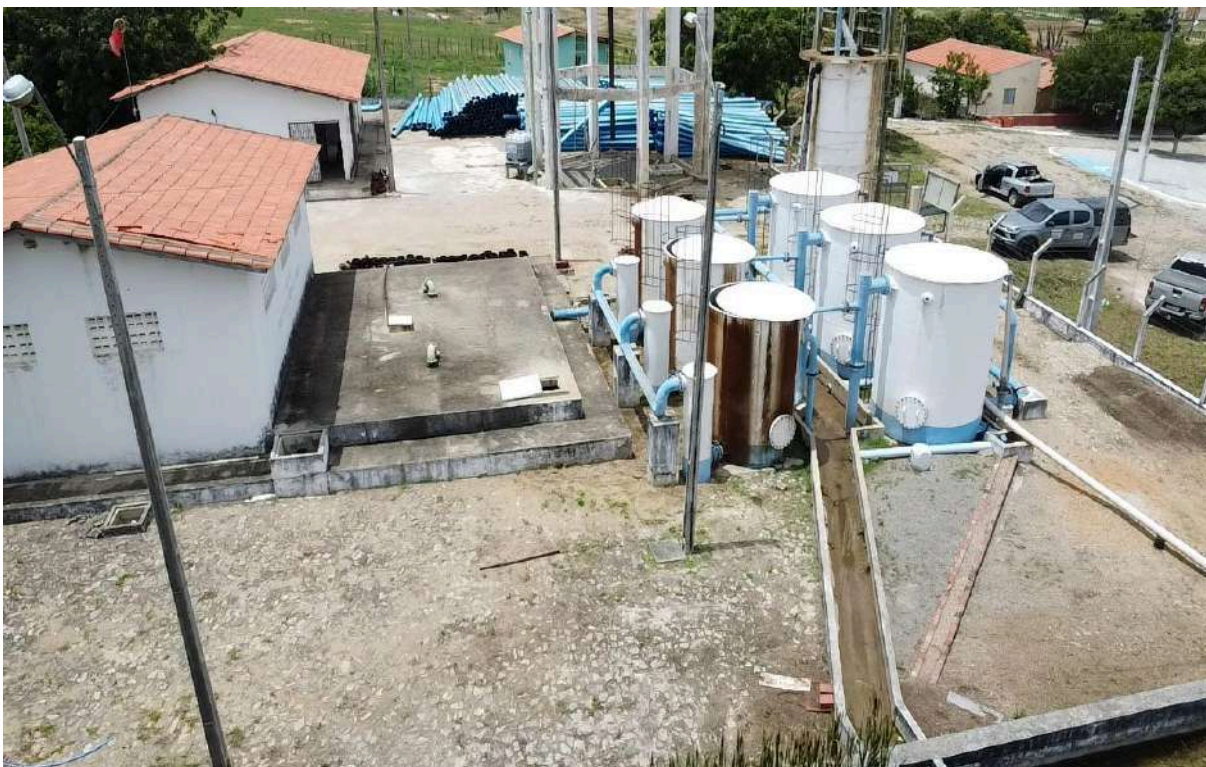
Foto 42 - ETA-02 - Mamoeiro: pintura e identificação das infra estruturas deterioradas (filtros, reservatórios, entre outros).
