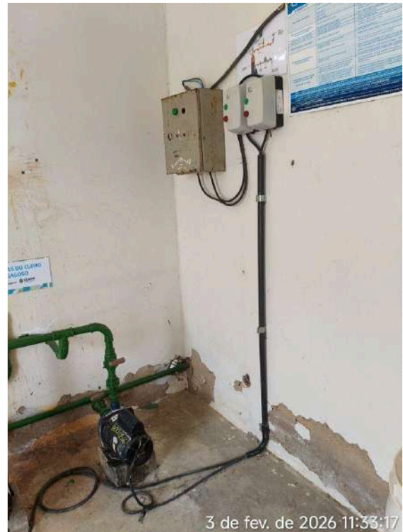
Foto 46 - Estação de Cloro / Casa de Química: reboco e pintura deteriorados e pisos danificados.
