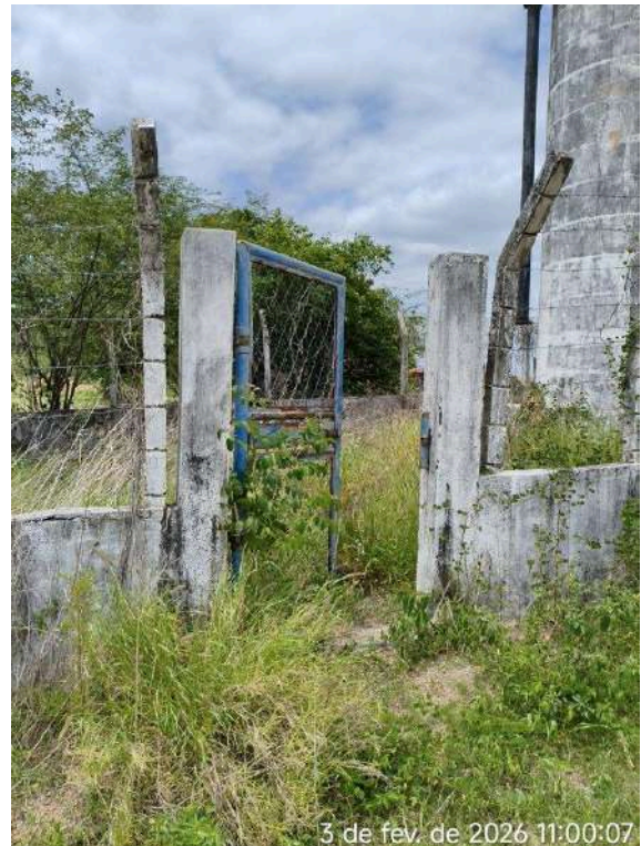
Foto 33 - Torre de Amortecimento (TAU-02): infraestrutura apresenta cerca e tranca do portão danificada.
