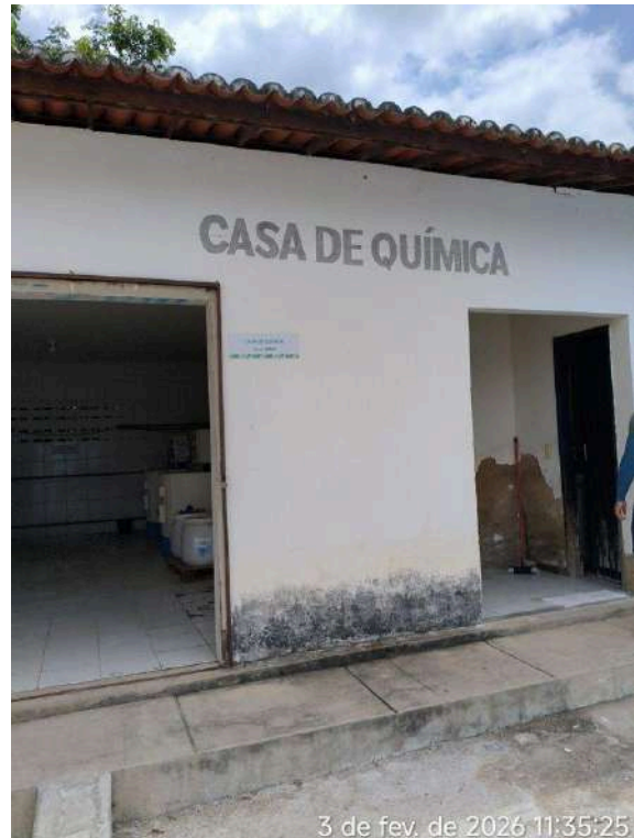
Foto 48 - Estação de Cloro / Casa de Química: reboco e pintura deteriorados.
