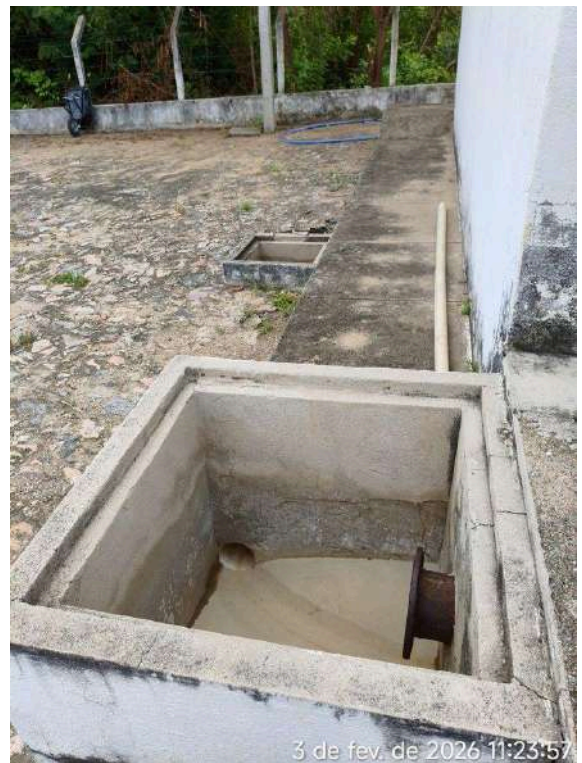
Foto 8 - caixa de proteção e inspeção sem tampa.
