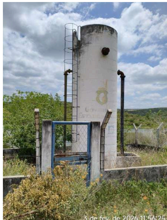
Foto 35 - Torre de Equilíbrio 01: apresenta crescimento excessivo de vegetação e pintura deteriorada.
