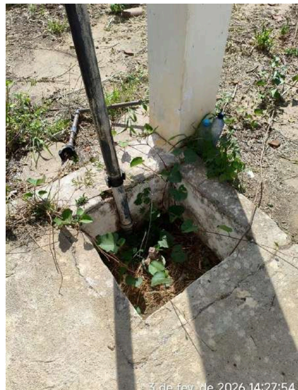
Foto 20 - REL-02 (Vila Mariana): caixa de proteção e inspeção sem tampa/grade.
