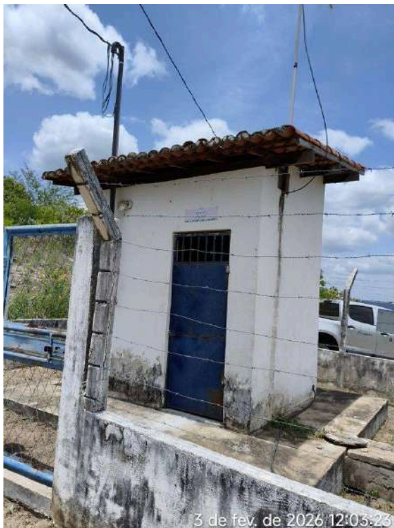
Foto 24 - Casa dos Quadros de Comando (EECS-02): estrutura com pintura e identificação desgastada.
