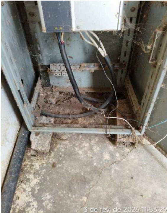
Foto 1 - Casa dos Quadros de Comando: Quadro instalado sobre base improvisada e fios / cabos sem eletrodutos de proteção e isolamento.
