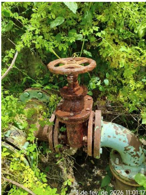
Foto 34 - Torre de Amortecimento (TAU-02): registro com vazamento.
