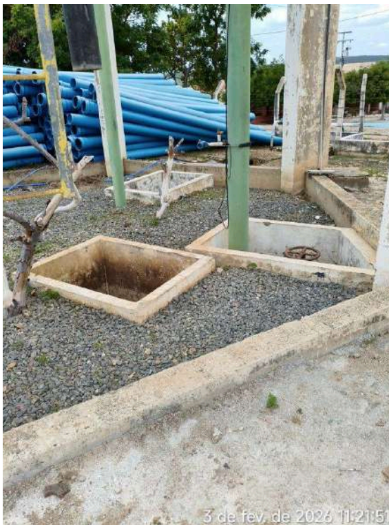
Foto 7 - caixas de proteção e inspeção sem tampas.
