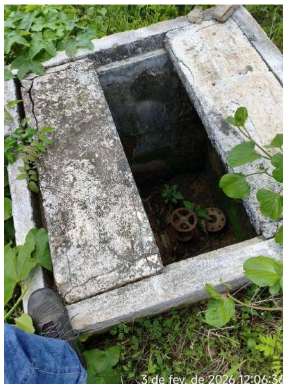
Foto 27 - Adutora: com tampas quebradas ou ausentes ao longo da linha da adutora.
