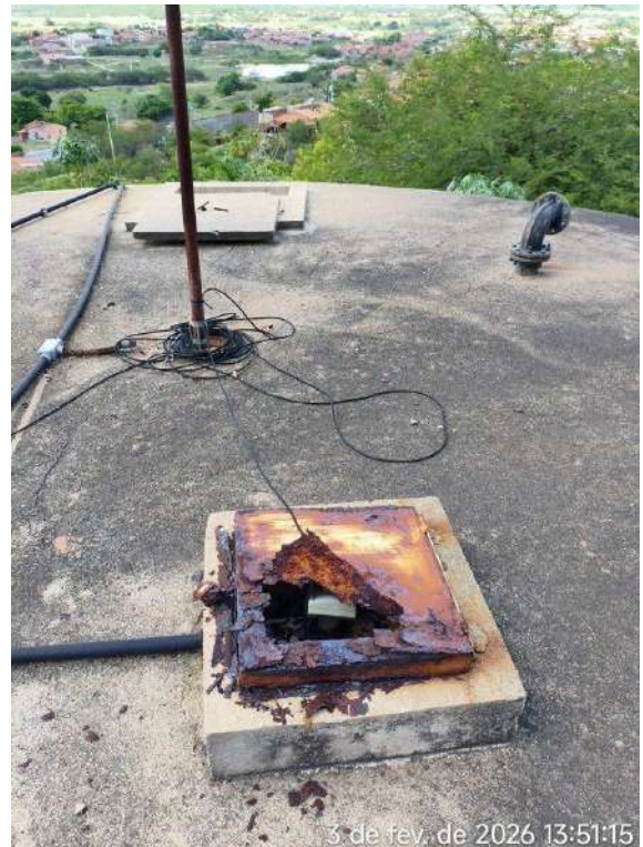
Foto 62 - RAP-04: tampa de inspeção fora do lugar e tampa de proteção e inspeção corroída.
