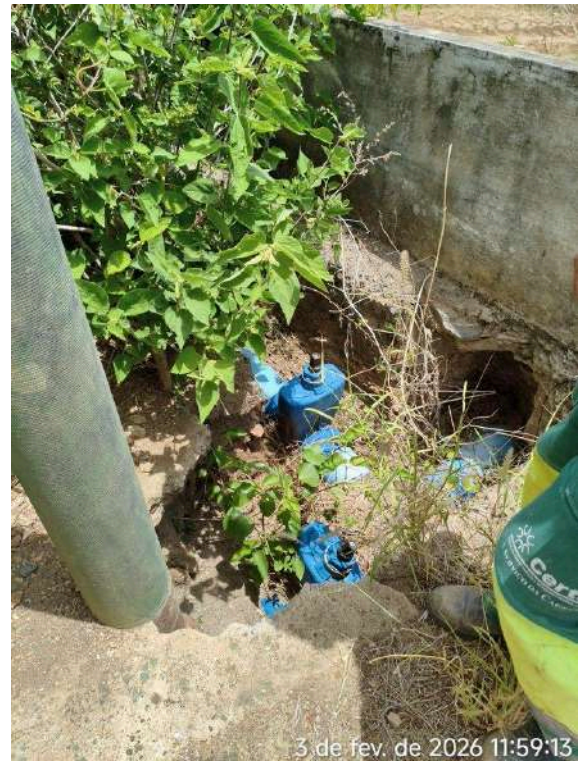
Foto 6 - Torre de Equilíbrio (TE-02): registros de manobras instalados sem caixa de proteção.
