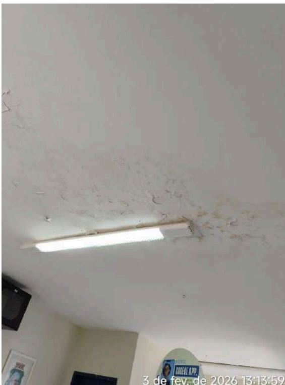
Foto 63 - Escritório Operacional: apresenta manchas de infiltração / vazamento no teto e pintura deteriorada.
