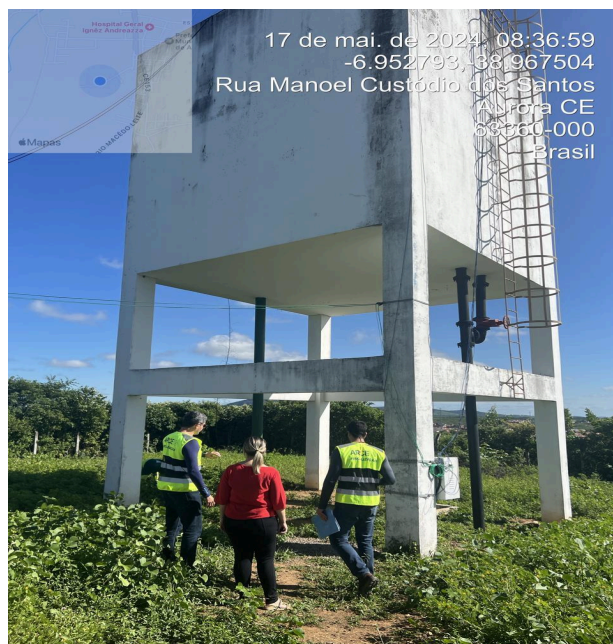
Foto 4 - REL 2: pintura desgastada.
