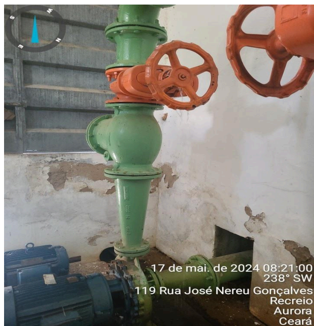
Foto 3 - EEAT 1: vazamento no registro da bomba.
