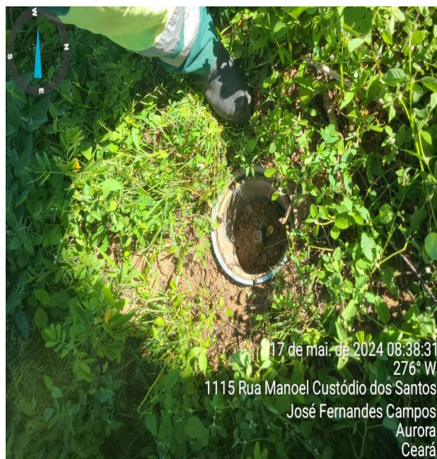
Foto 8 - REL 2: registro sem caixa de proteção.
