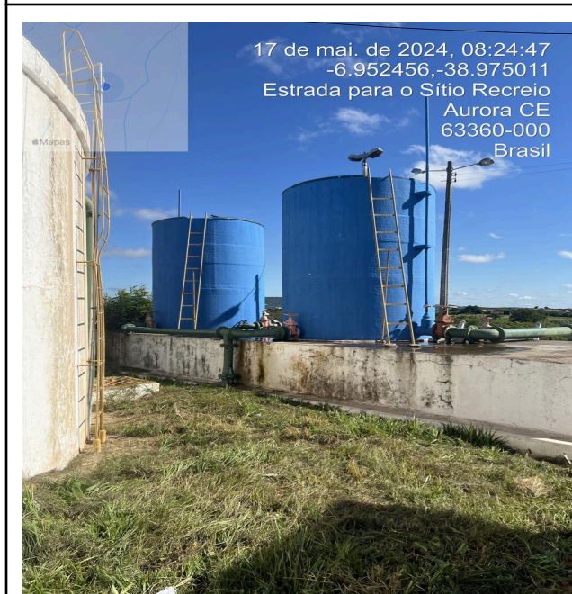
Foto 9 - Filtros: ausência de identificação.
