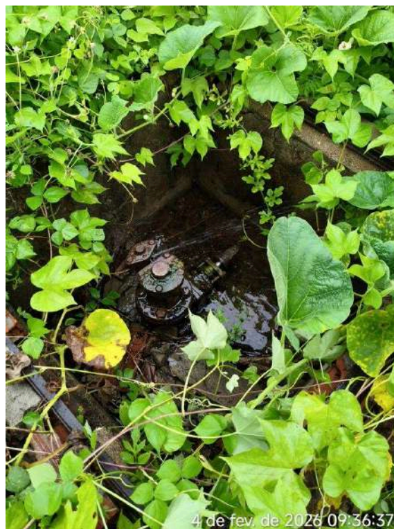
Foto 40 - Adutora de água bruta: ventosa com vazamento.
