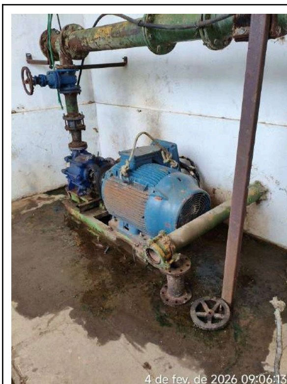
Foto 37 - EEAB-01: Há acúmulo de água de drenagem no piso da casa de bombas.
