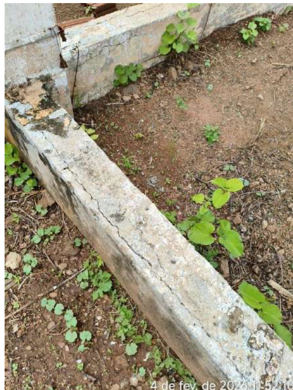
Foto 59 - REL-01: pintura deteriorada, rachaduras e ferragens expostas.
