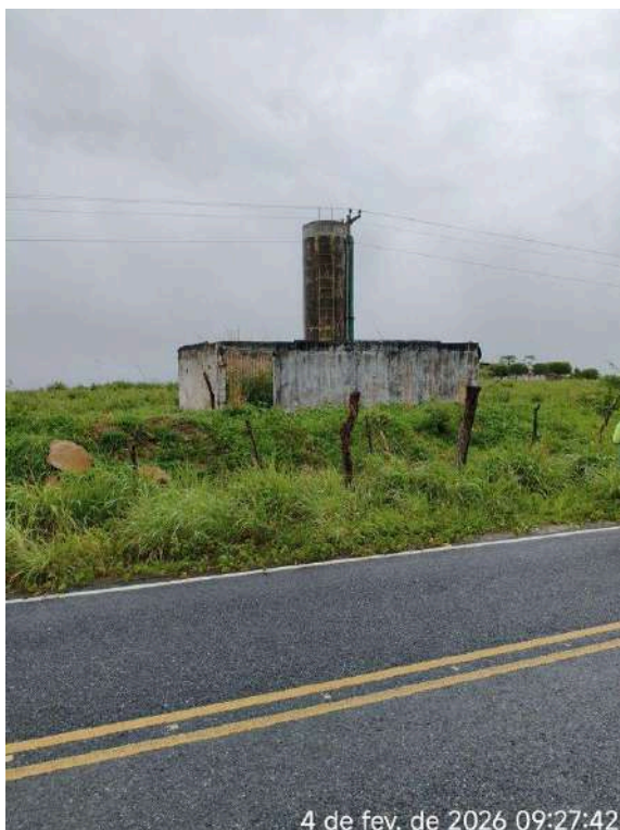
Foto 43 - Torre Piezométrica: pintura deteriorada e vegetação crescida, impedindo o acesso.
