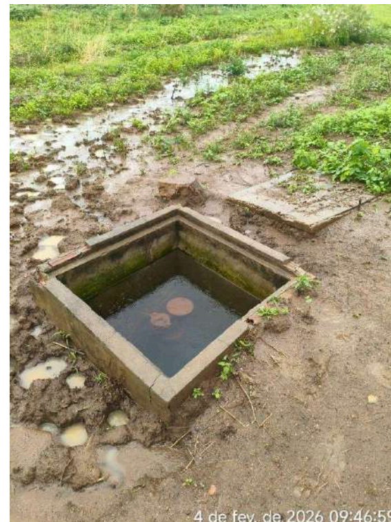
Foto 8 - Adutora de Água Bruta: caixa de proteção e inspeção desprovida de tampa.
