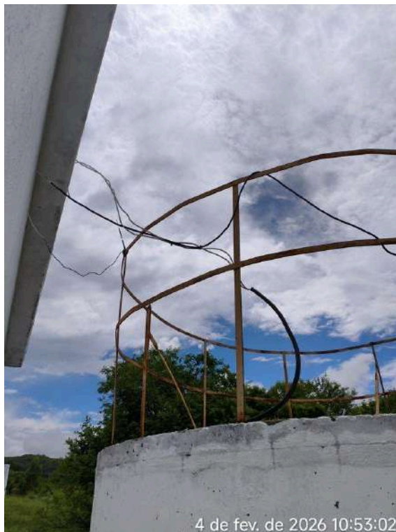
Foto 29 - RSE-02 / EEAT-03: Ifios / cabos fixados ao guarda-corpo sem eletroduto de isolamento e proteção.
