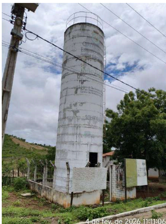
Foto 35 - REL-02: ausência de identificação.
