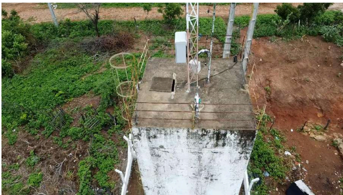
Foto 60 - REL-01: estrutura com pintura deteriorada, rachaduras, ferragens expostas e tampa de inspeção sem vedação total.
