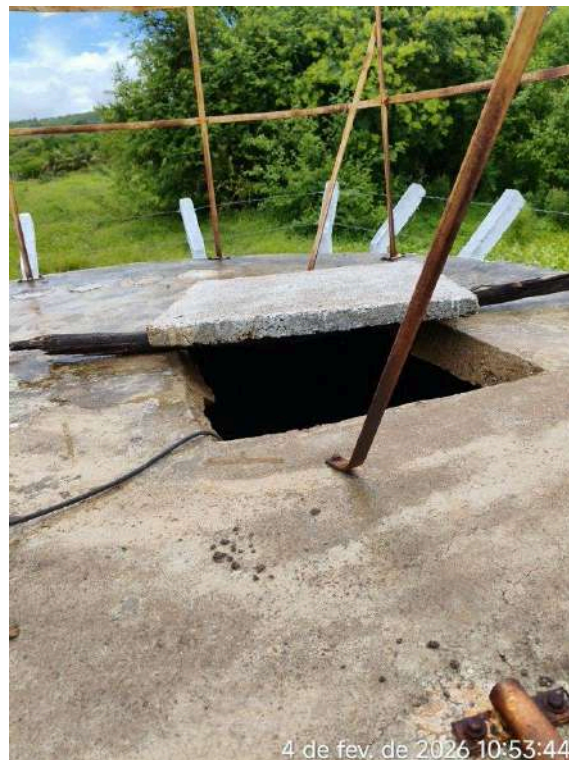
Foto 30 - RSE-02 / EEAT-03: fio / cabo adentrando através da abertura de inspeção sem fechamento hermético.
