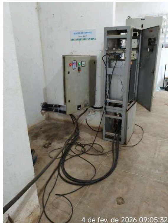
Foto 2 - EEAB-01: fios/cabos emaranhados sobre o piso, sem eletrodutos de isolamento e proteção.
