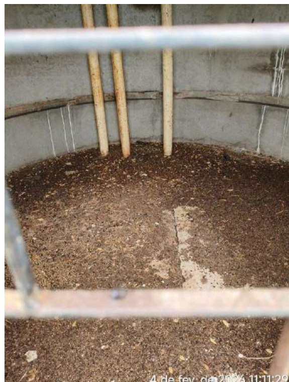
Foto 54 - REL-02: base do fuste com acúmulo de sujeira.
