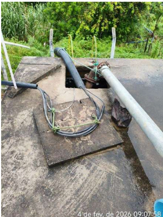
Foto 4 - RAP-01: Fios/cabos e tubulações instaladas de forma irregular, através da abertura de inspeção sem fecho hermético.
