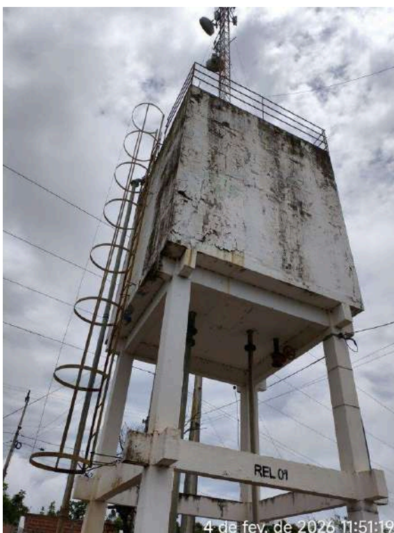
Foto 56 - REL-01: pintura deteriorada, rachaduras e ferragens expostas.
