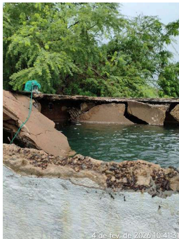
Foto 52 - RSE-01: laje superior destruída; pintura e identificação desgastadas e fiação e cordas expostas.
