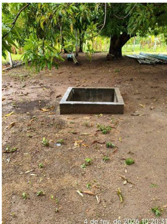
Foto 15 - Pátio: caixa de proteção e inspeção sem tampa.
