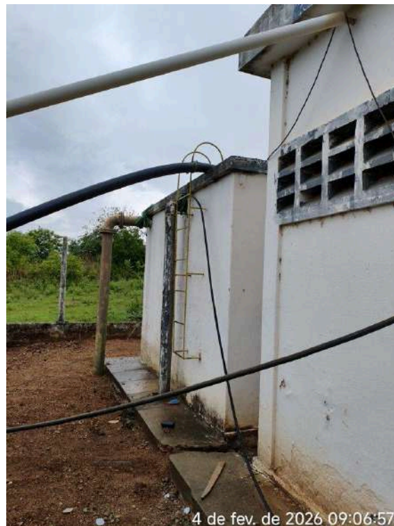
Foto 6 - RAP-01: a escada marinho inadequada, sem gaiola de proteção e guarda-corpo no patamar superior.
