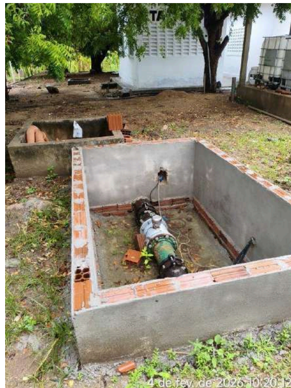
Foto 14 Pátio: caixa de proteção e inspeção sem tampa.
