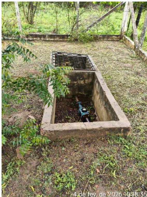
Foto 13 - Pátio: caixa de proteção e inspeção sem tampa.
