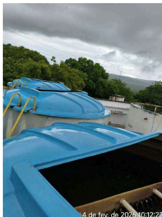
Foto 20 - Filtros: abertura superior e saídas de água tratada desprotegidas, com tampas incompletas e sem tampas, respectivamente.
