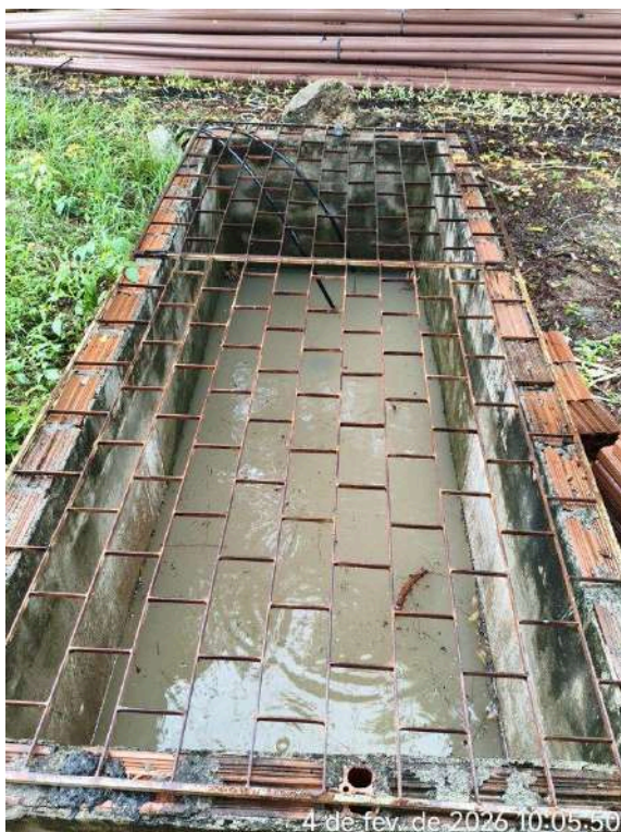
Foto 45 - ETA_macromedicação: caixa do macromedidor de água bruta está inundada.
