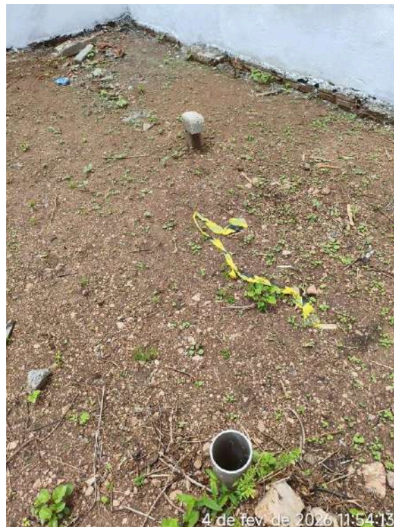
Foto 34 - REL-01: registros sem caixas de proteção e inspeção.
