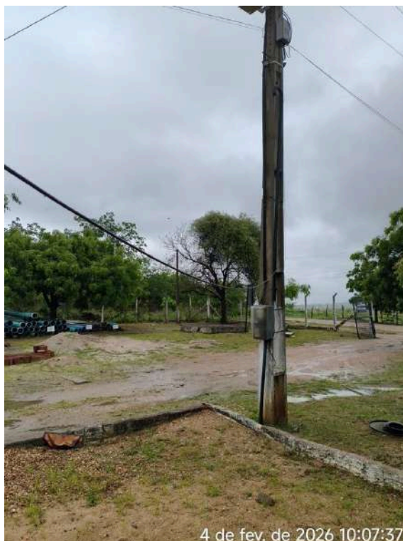
Foto 23 - Cloração: fio / cabo de alimentação elétrica instalado em altura baixa.
