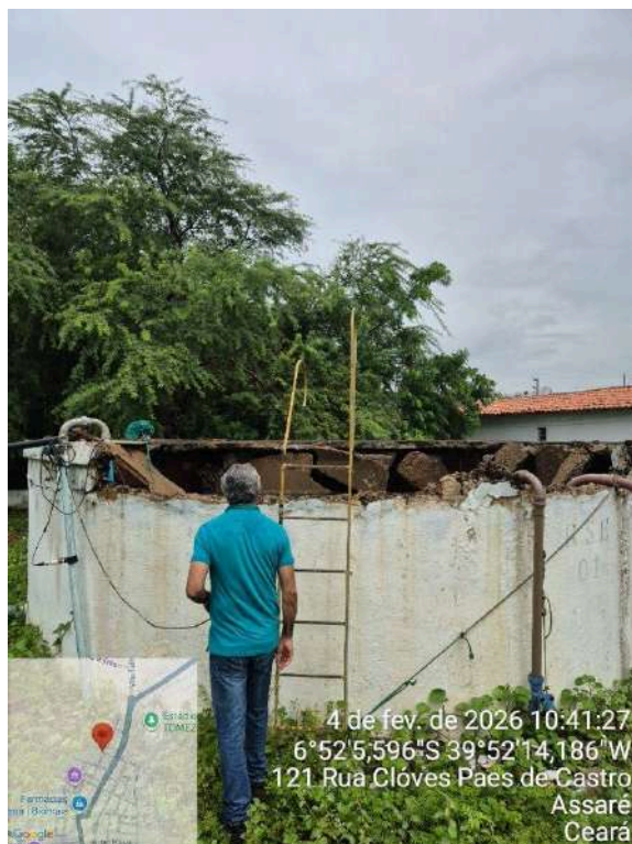
Foto 51 - RSE-01: laje superior destruída; pintura e identificação desgastadas e fiação e cordas expostas.
