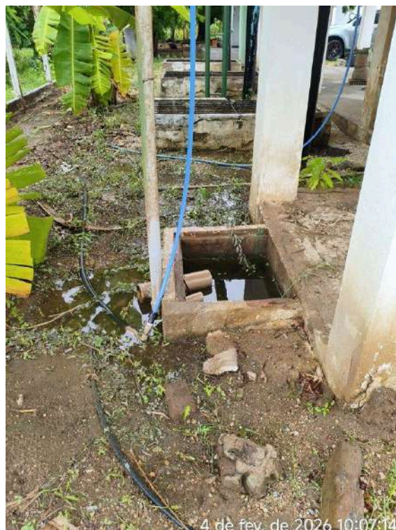
Foto 12 - Pátio: caixa de proteção sem tampa e tubulações expostas sobre o solo na área de circulação.
