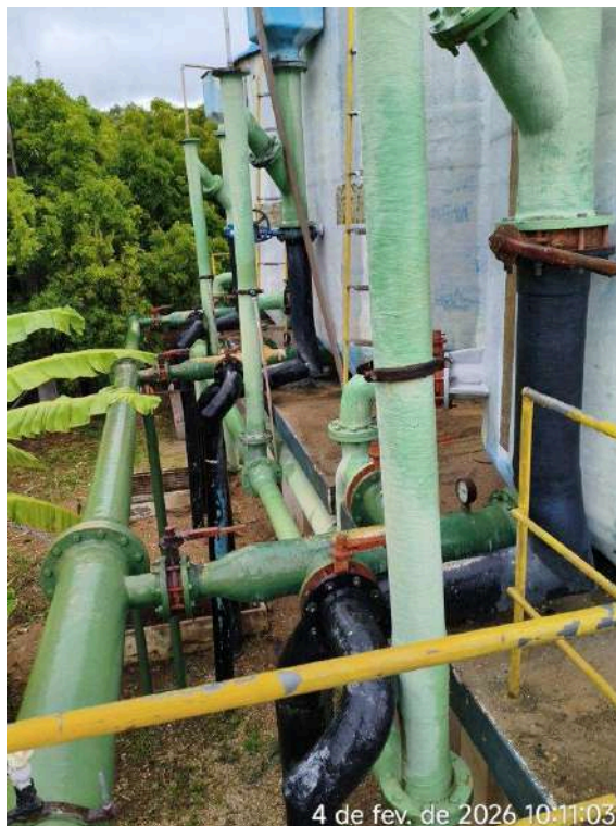
Foto 17 - Filtros: guarda-corpo / grade de proteção da plataforma está incompleto.
