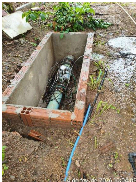
Foto 10 - Pátio: caixas de proteção sem tampas e tubulações expostas sobre o solo na área de circulação.
