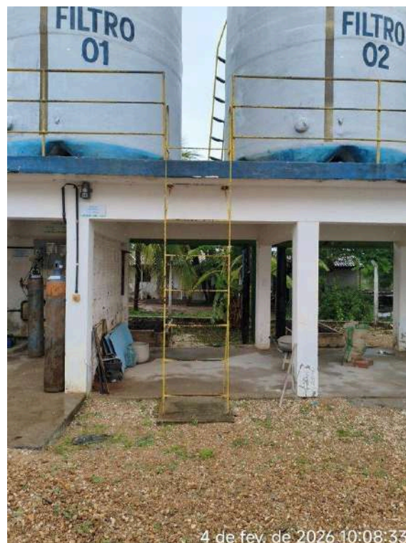
Foto 16 - Filtros: escada tipo marinheiro sem gaiola de proteção.
