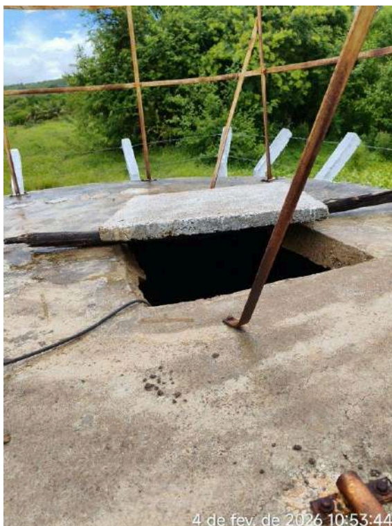
Foto 53 - RSE-02: a tampa de inspeção foi encontrada aberta.
