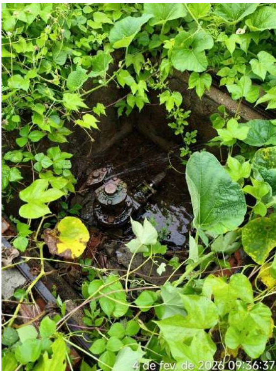
Foto 7 - Adutora de Água Bruta: caixa de proteção e inspeção desprovida de tampa.
