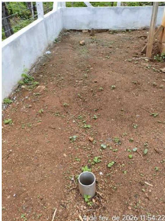
Foto 33 - REL-01: registros sem caixas de proteção e inspeção.
