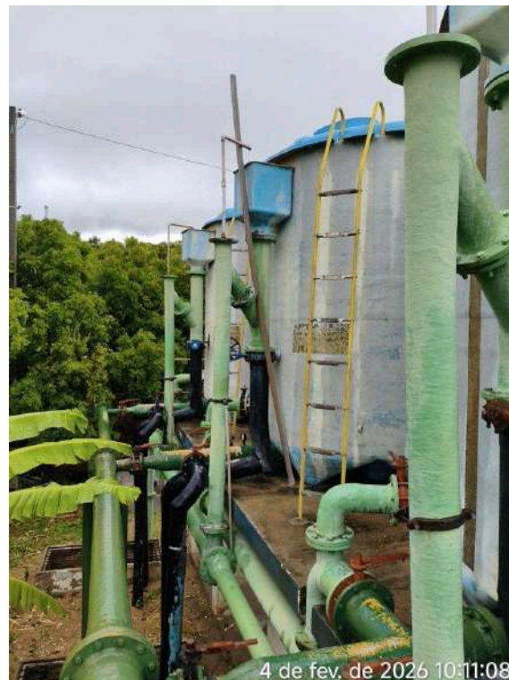
Foto 18 - Filtros: escadas tipo marinheiro inadequadas, sem gaiolas de proteção e trecho da plataforma sem guarda-corpo / grade de proteção.
