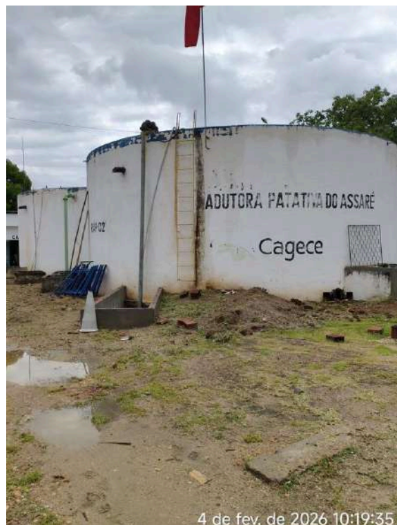
Foto 24 - RAP-02 / RAP-03: escada tipo marinho sem gaiola de proteção e guarda-corpo / grade de proteção no patamar superior.
