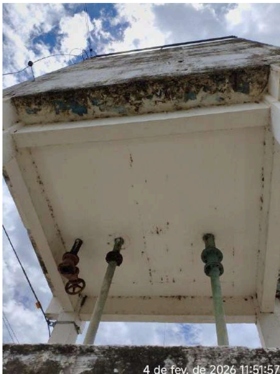
Foto 58 - REL-01: pintura deteriorada, rachaduras e ferragens expostas.
