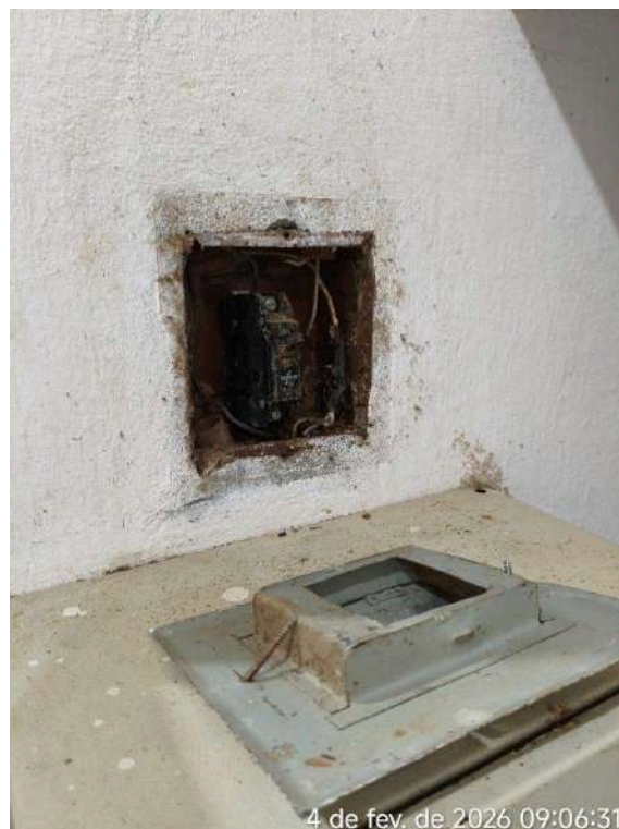
Foto 38 - EEAB-01: caixa de disjuntor sem tampa.
