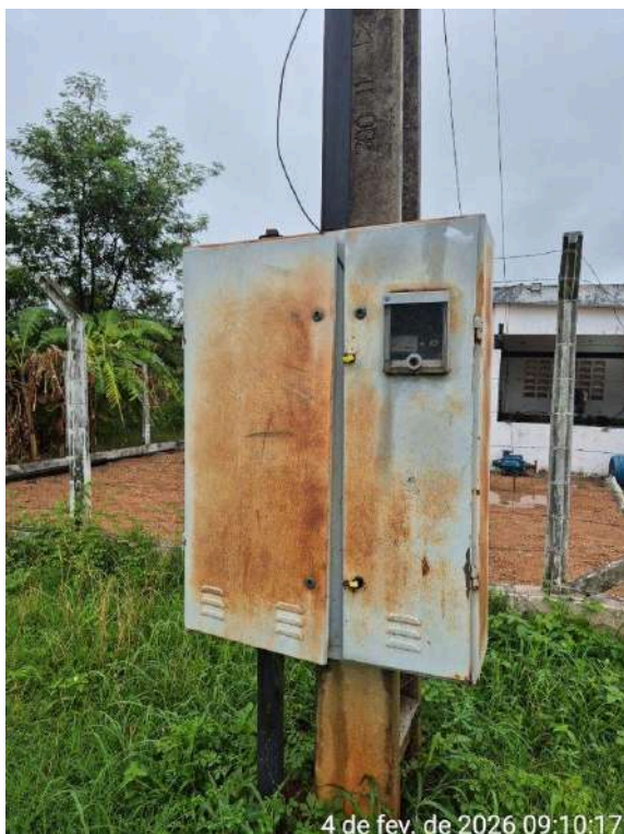
Foto 39 - EEAB-01: quadro de energia apresenta corrosão e fio exposto.
