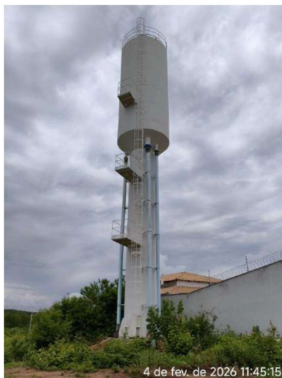
Foto 36 - REL-03: ausência de identificação; área do perímetro não possui isolamento definido.
