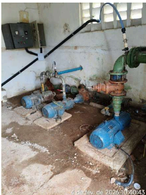
Foto 49 - EERD-01 / EEAT-02: piso e paredes deteriorados e desgastados.
