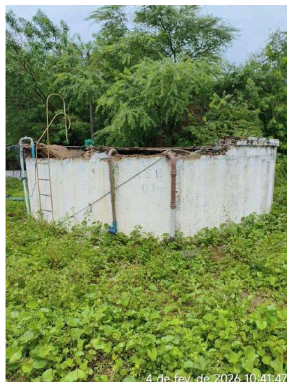
Foto 50 - RSE-01: laje superior destruída; pintura e identificação desgastadas e fiação e cordas expostas.
