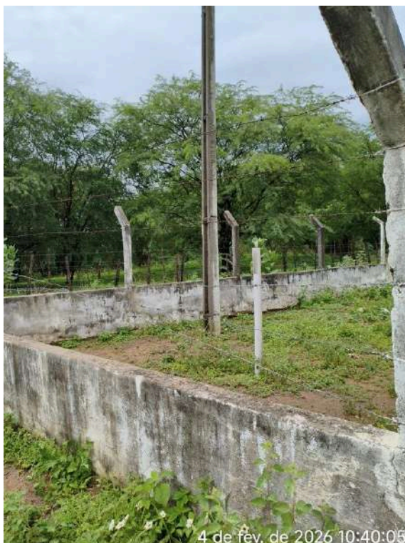
Foto 47 - RSE-01 / EERD-01 / EEAT-02: cerca danificada.
