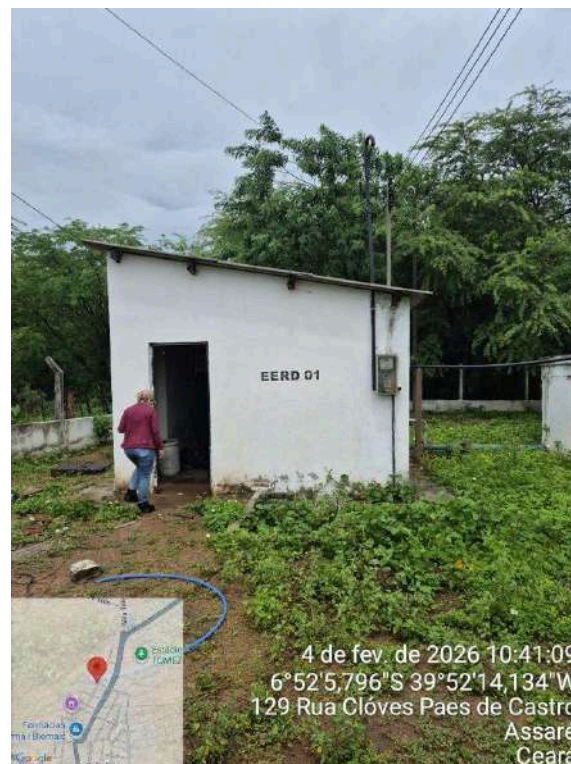
Foto 48 - EERD-01 / EEAT-02: vegetação crescida na área interna.
