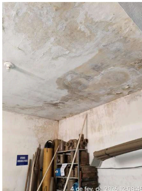
Foto 62 - Escritório / Almoxarifado: estrutura com pintura deteriorada e sinais de infiltração de água no teto.
