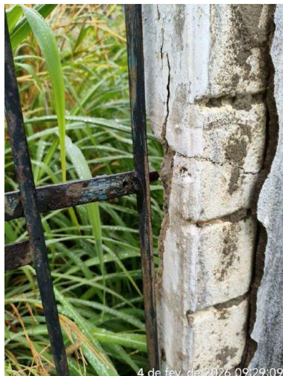
Foto 42 - Torre Piezométrica: tranca do portão danificada.
