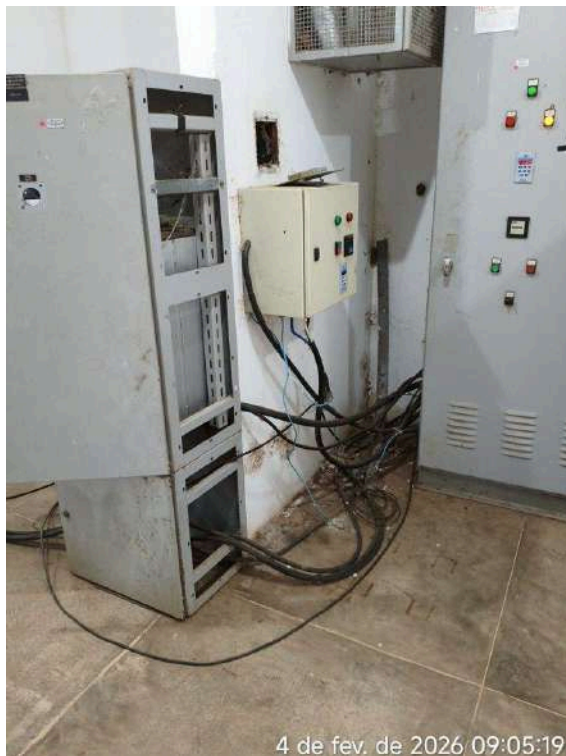
Foto 1 - EEAB-01: fios/cabos emaranhados sobre o piso, sem eletrodutos de isolamento e proteção.
