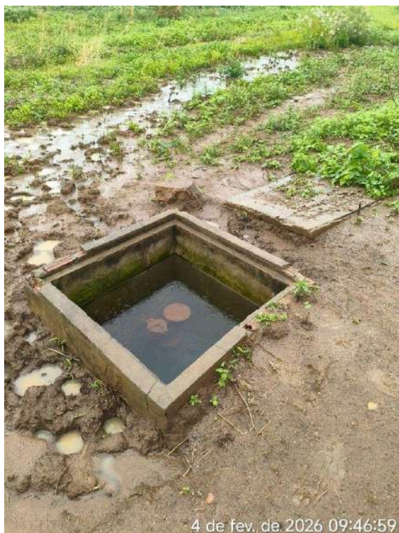
Foto 41 - Adutora de água bruta: ventosa com vazamento.
