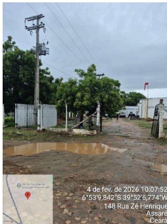
Foto 44 - ETA: portão danificado.
