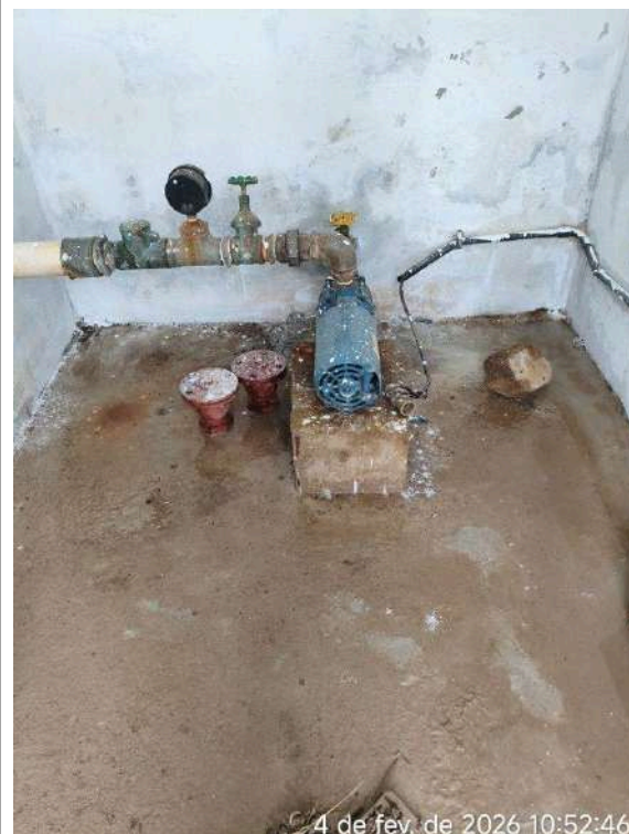
Foto 28 - RSE-02 / EEAT-03: Acúmulo de água no piso por falta de drenagem.
