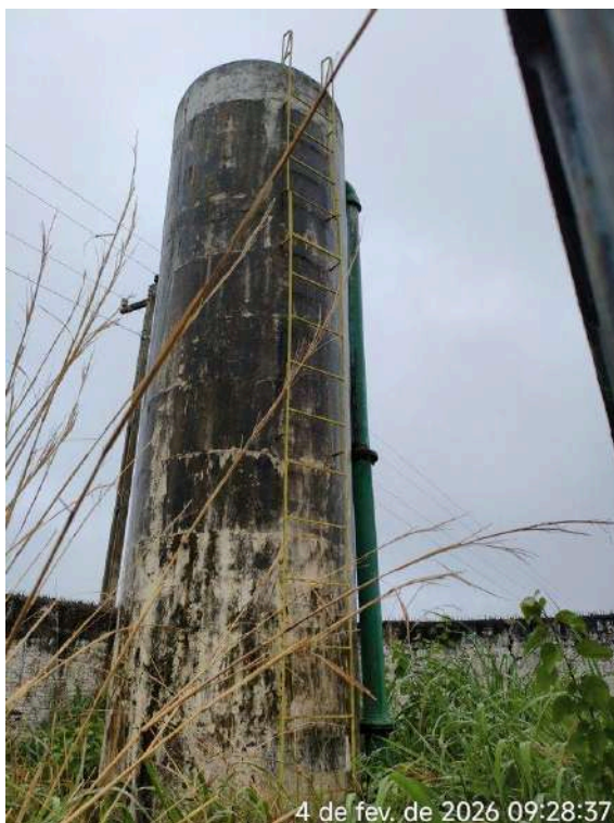
Foto 9 - Torre Piezométrica: sem identificação visível e escada tipo marinheiro sem gaiola de proteção.
