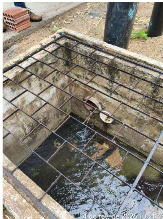
Foto 46 - ETA /Filtros: vazamento filtro F-03.
