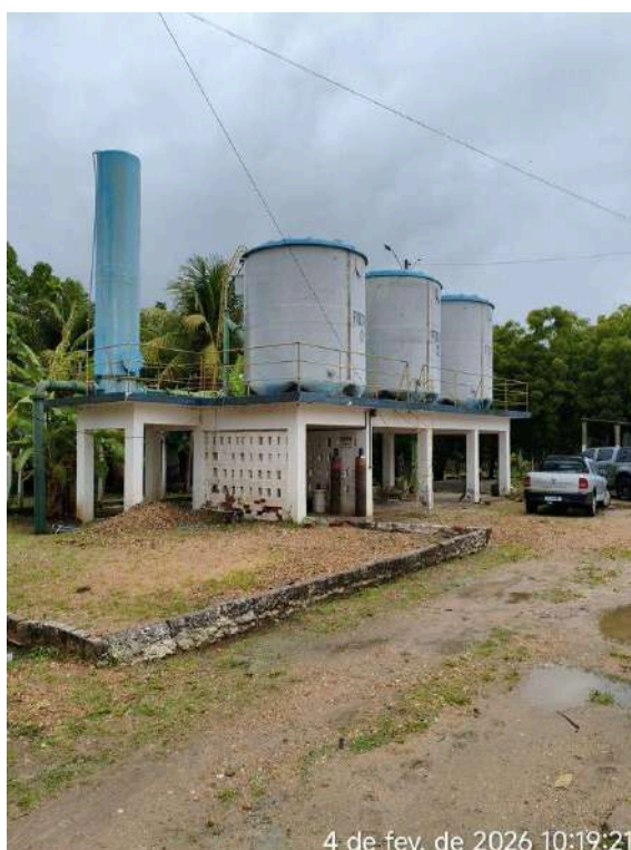
Foto 19 - Filtros e Plataformas: Escadas tipo marinheiro sem gaiolas de proteção. A plataforma possui guarda-corpo incompleto.
