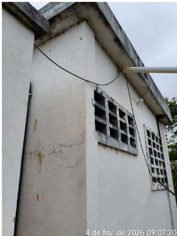
Foto 5 - RAP-01: fios/cabos através de cobogós, sem eletrodutos de isolamento e proteção.
