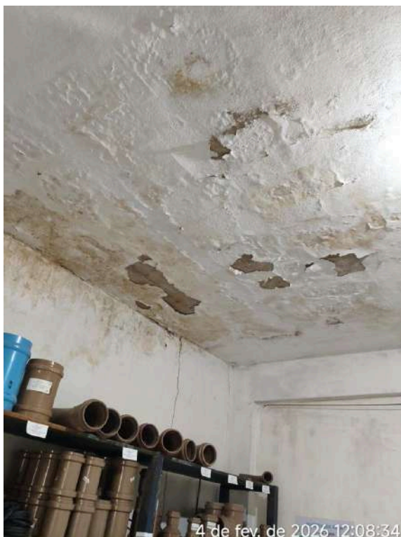
Foto 61 - Escritório / Almoxarifado: estrutura com pintura deteriorada e sinais de infiltração de água no teto.
