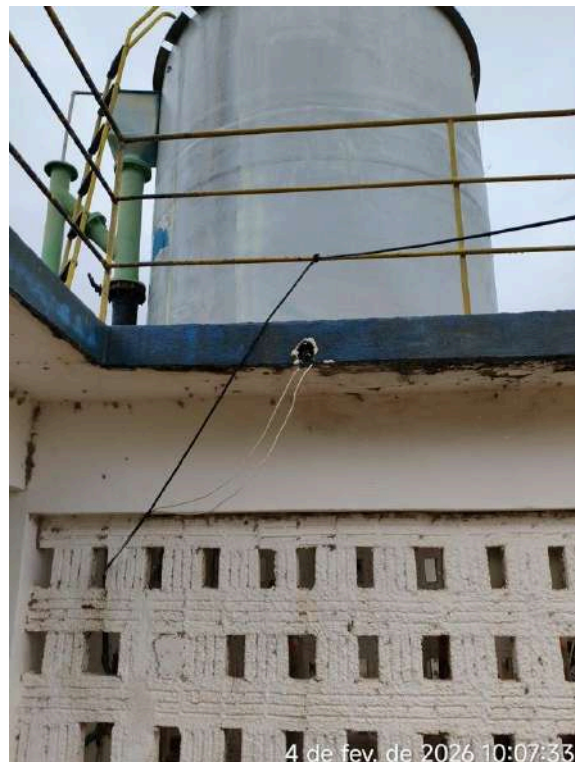
Foto 22 - Cloração: fio / cabo preso ao guarda-corpo / grade de proteção dos filtros.
