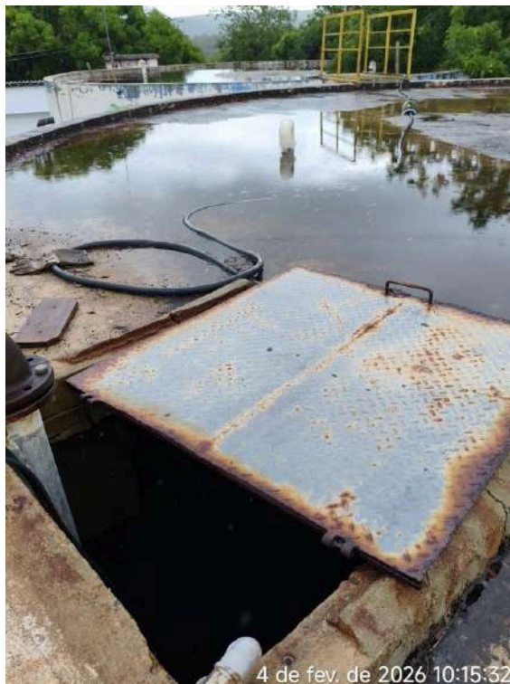
Foto 25 - RAP-02 / RAP-03: tubulações e fiação instalada de forma inadequada; falta drenagem da água na laje de cobertura.
