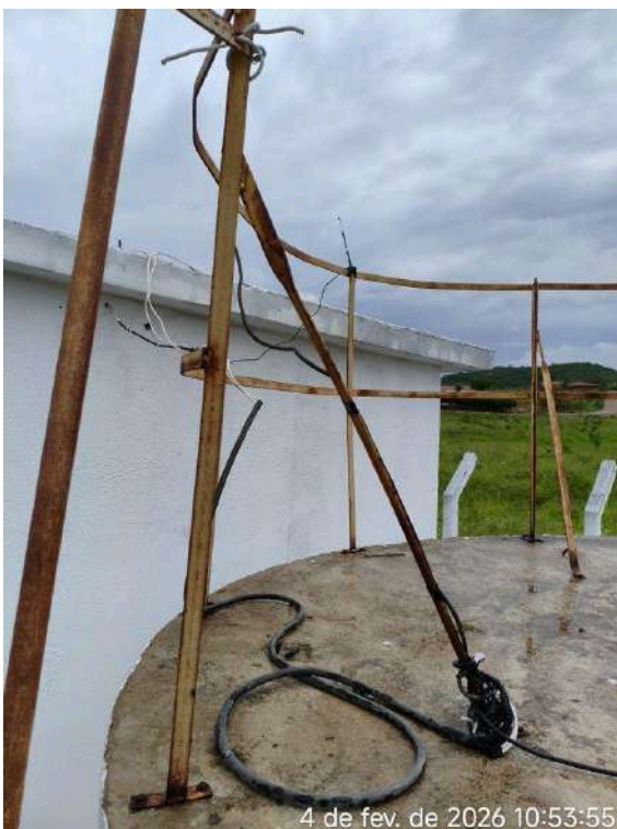
Foto 31 - RSE-02 / EEAT-03: Acúmulo de água no piso por falha na drenagem. Instalações elétricas irregulares (fios fixados no guarda-corpo e passando pela abertura de inspeção).
