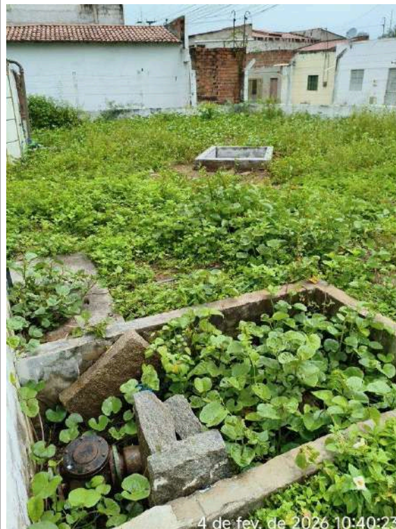
Foto 26 - RSE-01 / EERD-01 / EEAT-02: caixas sem tampa ou grade.
