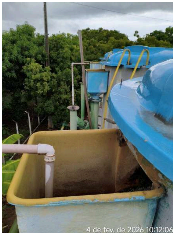
Foto 21 - Filtro: filtros com abertura superior e saídas de água tratada desprotegidas, com tampas incompletas e sem tampa.
