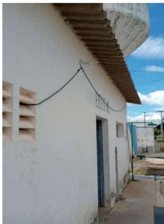
Foto 11 - EEAT-01: a estação elevatória tem fiação/cabo instalados de forma precária sem eletroduto, passando através de combogó.
