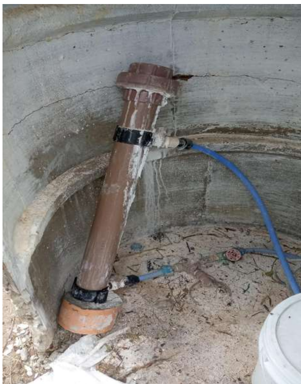
Foto 32 - PT-12: instalações de cloração danificadas.
