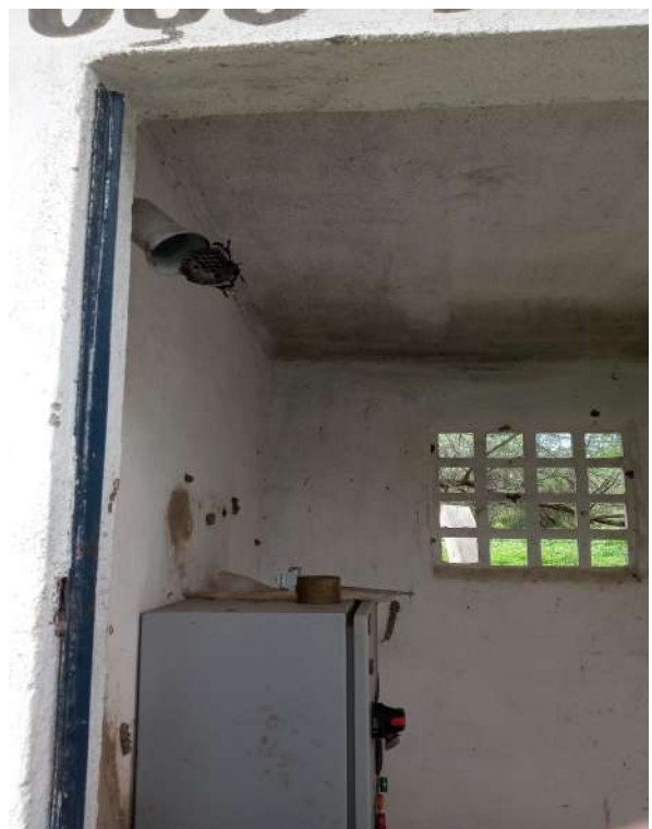
Foto 35 - PT-03: casa do quadro de comando sem iluminação.
