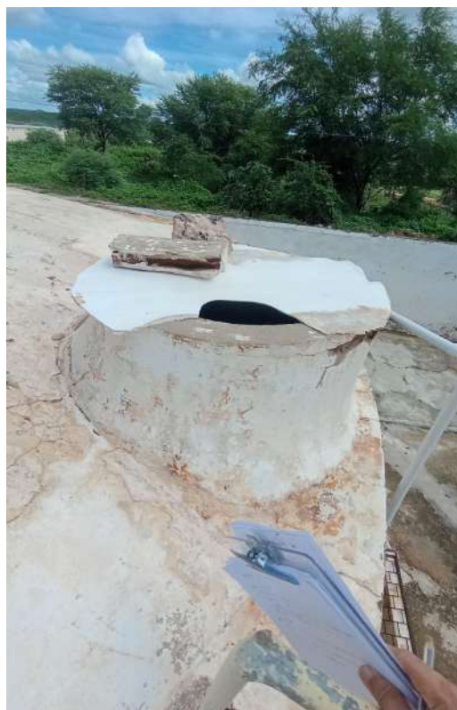
Foto 3 - RAP-01: tampa do reservatório inadequada, sem fechamento hermético.
