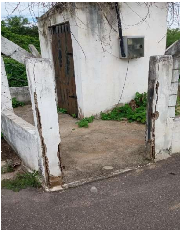
Foto 42 - PT-NI_2 (sem identificação): poço desativado com infraestrutura e instalações deterioradas, acessíveis, em completo abandono.
