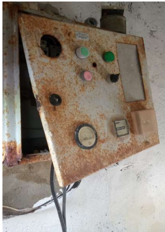
Foto 41 - PT-NI_1 (sem identificação): quadro de comando deteriorado.
