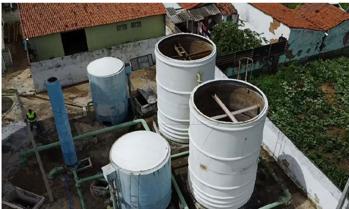
Foto 1 - Filtros F-01 e F-02: estão com escada de acesso tipo marinho inadequadas.
