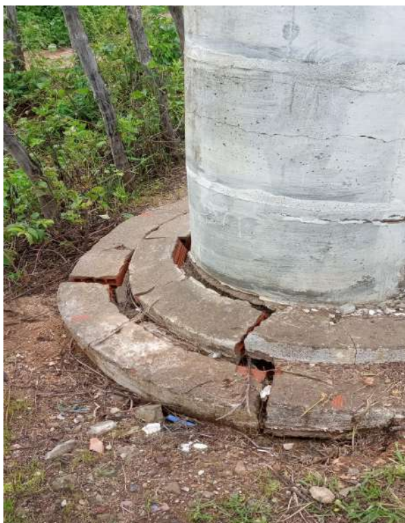
Foto 28 - PT-12: infraestrutura deteriorada.
