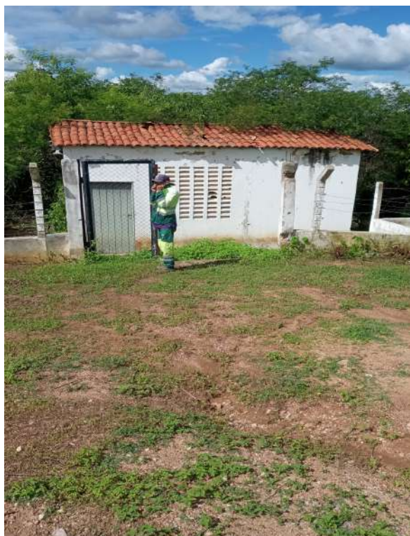
Foto 22 - Captação: a casa do quadro de comando está com cerca e telhado danificados, e tem uma colmeia de abelhas instaladas no prédio, dificultando o acesso.
