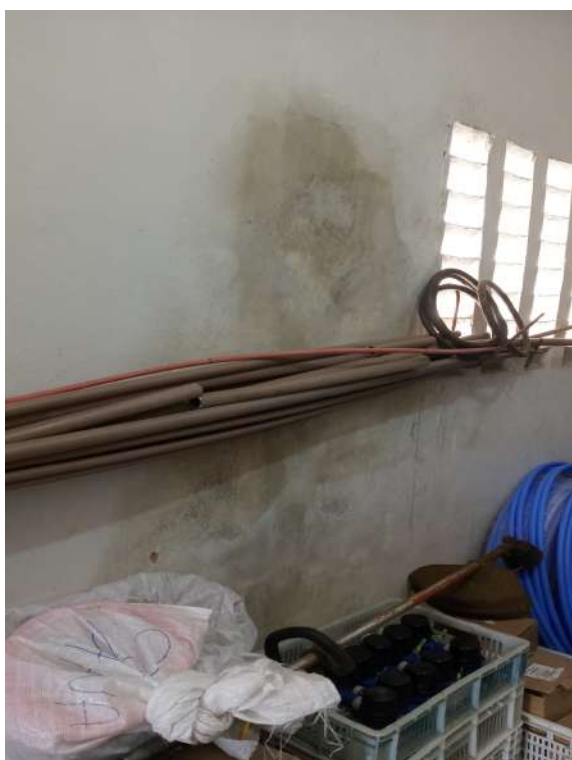
Foto 18 - Escritório Operacional / Almoxarifado: apresenta paredes com pintura deteriorada na área de atendimento, de serviço e almoxarifado.
