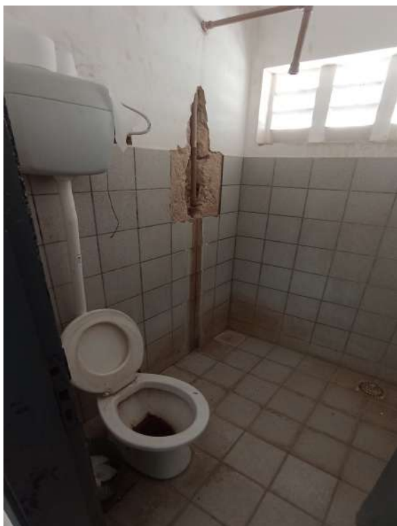
Foto 24 - Laboratório: banheiro com pintura, equipamento e revestimentos deteriorados.
