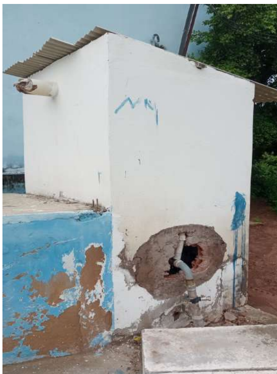
Foto 38 - PT-NI_1 (sem identificação): poço sem identificação com infraestrutura deteriorada.
