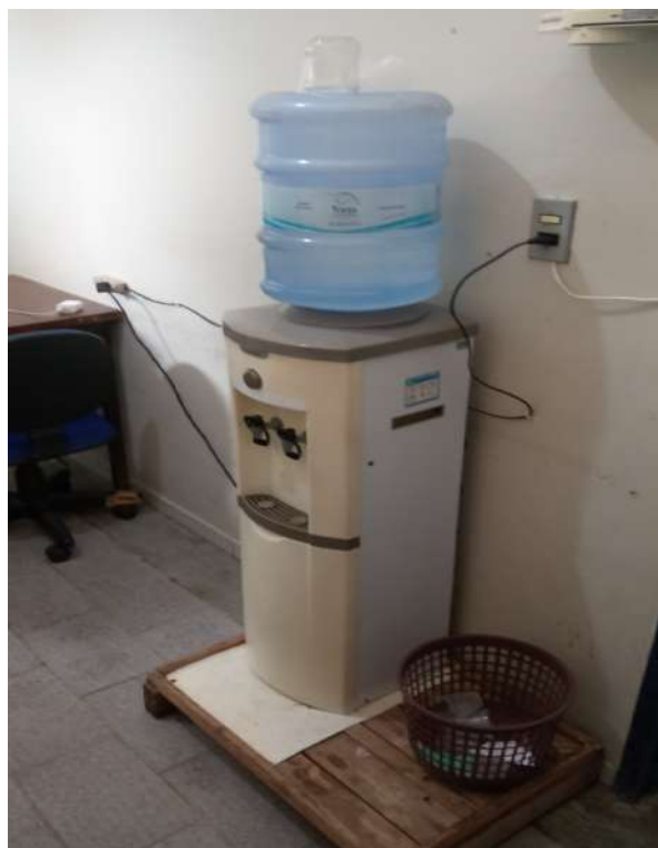
Foto 20 - Escritório Operacional / Almojarifado: equipamento de água potável (gelágua) não está disponível de forma visível e acessível para os usuários em espera de atendimento.
