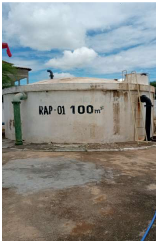
Foto 2 - RAP-01: a escada do reservatório e a ventilação do reservatório estão inadequadas.
