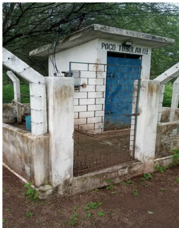
Foto 33 - PT-03: o poço encontra-se com identificação e pintura desgastadas e sem cadeado de segurança de fechamento do portão de acesso.
