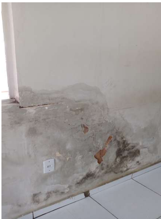
Foto 16- Escritório Operacional / Almoxarifado: apresenta paredes com pintura deteriorada na área de atendimento, de serviço e almoxarifado.
