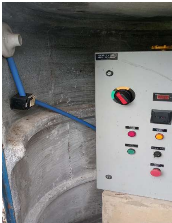
Foto 37 - PT-04: sem iluminação.
