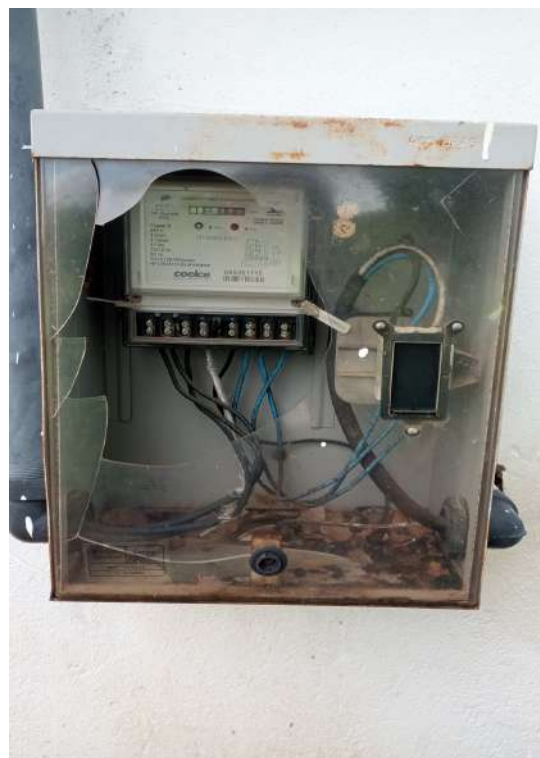
Foto 39 - PT-NI_1 (sem identificação): quadro de alimentação elétrica com tampa danificada.
