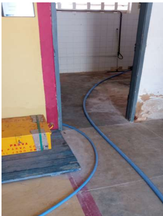
Foto 12 - Casa de Química: apresenta instalações hidráulicas de condução do tratamento químico (polímero e cloro) inadequadas com tubos instalados sobre o piso da área de circulação da ETA.
