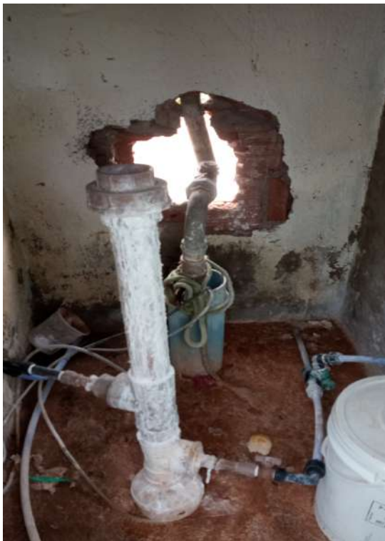
Foto 40 - PT-NI_1 (sem identificação): infraestrutura e instalações deterioradas.
