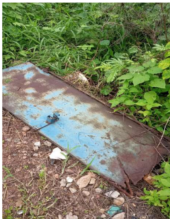
Foto 31 - PT-12: portão da casa dos quadros de comando danificado.
