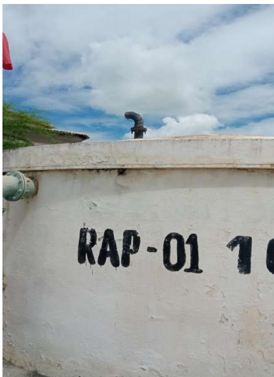
Foto 4 - RAP-01: ventilação do reservatório inadequada.
