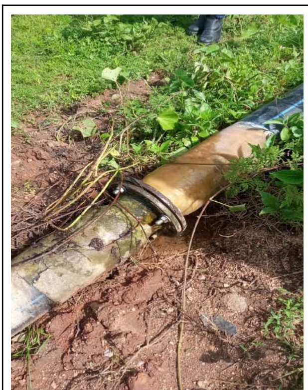
Foto 44 - Captação: adutora de água bruta apresenta princípio de vazamento.
