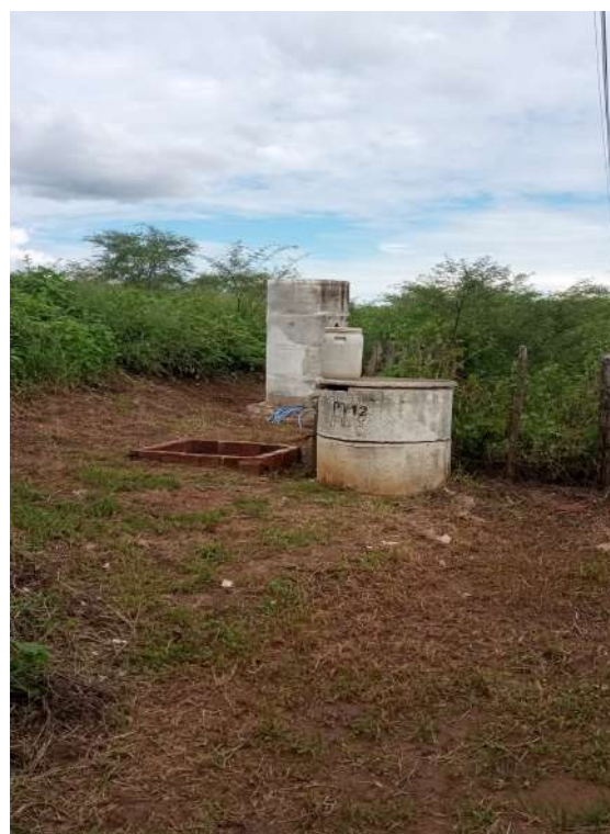
Foto 27 - PT-12: área do poço sem proteção de isolamento ao acesso, sem iluminação e pintura deteriorada.
