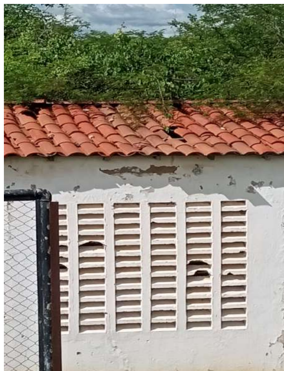
Foto 21 - Captação: a casa do quadro de comando está com cerca e telhado danificados, e tem uma colmeia de abelhas instaladas no prédio, dificultando o acesso.
