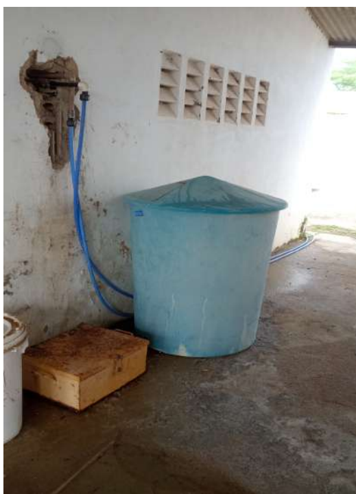
Foto 14 - Casa de Química: apresenta instalações hidráulicas de condução do tratamento químico (polímero e cloro) inadequadas com tubos instalados sobre o piso da área de circulação da ETA.
