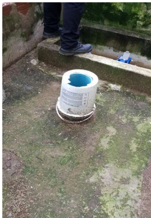
Foto 25 - PT-02: o poço encontra-se sem tamponamento de proteção e isolamento adequado.
