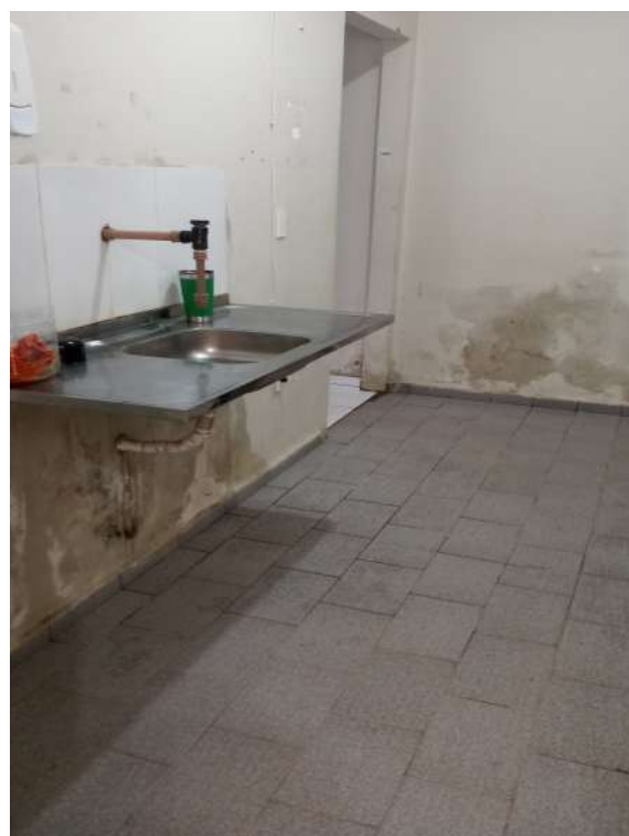
Foto 19 - Escritório Operacional / Almoxarifado: apresenta paredes com pintura deteriorada na área de atendimento, de serviço e almoxarifado.
