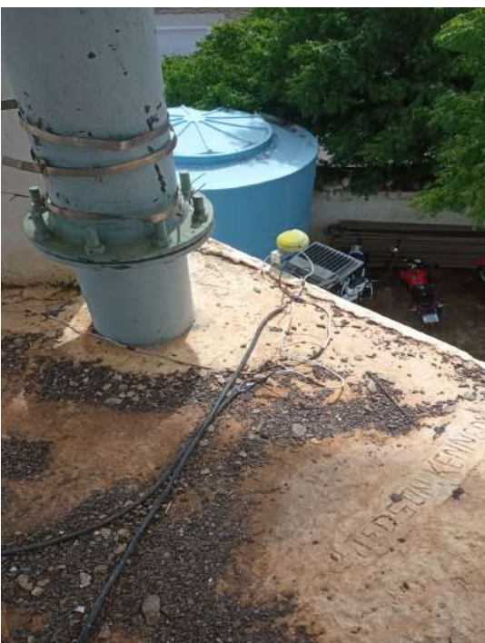
Foto 7 - REL-01: as lajes não tem grades de proteção e instalações elétricas inadequadas, com fiação sobre a laje, junto ao refletor.
