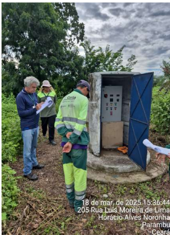
Foto 36 - PT-04: sem identificação e sem cadeado de fechamento do portão da casa do quadro de comando.
