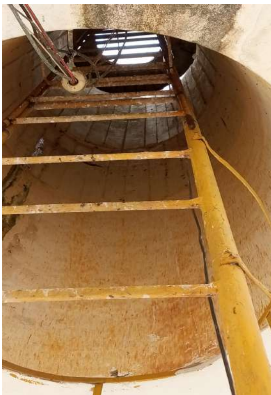
Foto 8 - REL-01: instalações elétricas inadequadas, conduzidas junto à escada.
