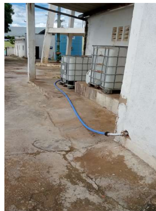
Foto 15 - Casa de Química: apresenta instalações hidráulicas de condução do tratamento químico (polímero e cloro) inadequadas com tubos instalados sobre o piso da área de circulação da ETA.
