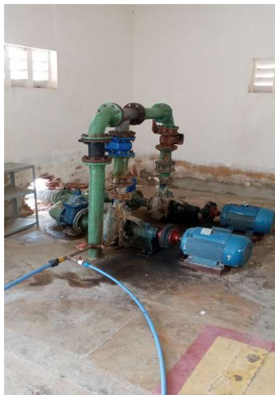
Foto 9 - EEAT-01: a estação elevatória tem tubulação de produtos químicos inadequada instalada sobre o piso da área de circulação.
