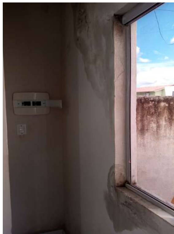
Foto 17 - Escritório Operacional / Almoxarifado: apresenta paredes com pintura deteriorada na área de atendimento, de serviço e almoxarifado.
