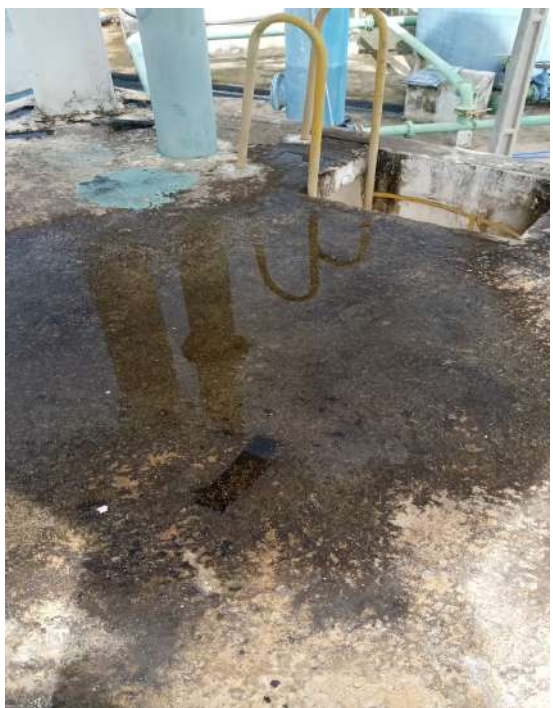
Foto 6 - REL-01: as lajes das plataformas de acesso não tem grades de proteção e a drenagem é inadequada, acumulando água da chuva.
