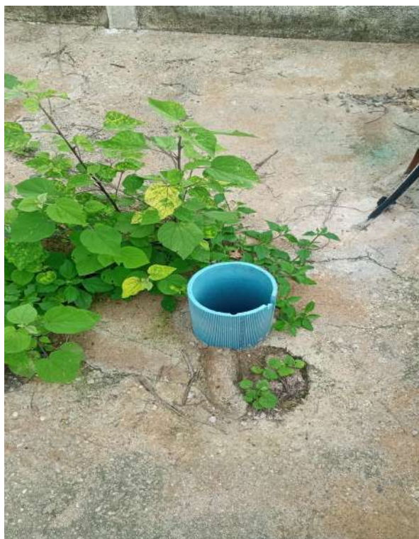
Foto 43 - PT-NI_2 (sem identificação): poço desativado, sem tampa, com infraestrutura e instalações deterioradas, acessíveis, em completo abandono.
