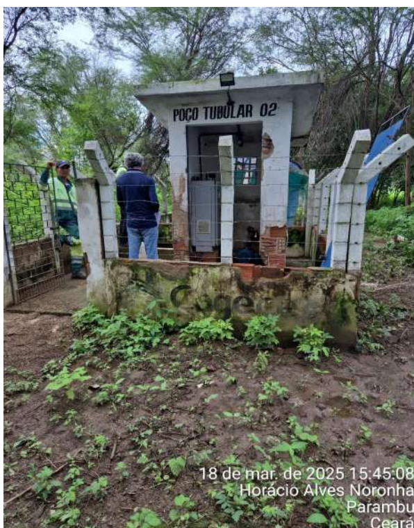
Foto 26 - PT-02: infraestrutura deteriorada, sem portão da casa do quadro de comando.
