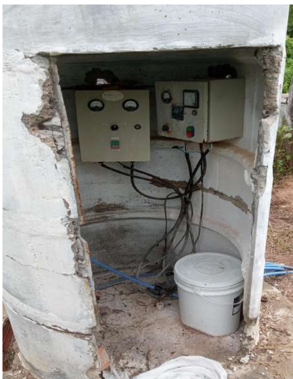
Foto 30 - PT-12: casa de quadros de comando sem porta e instalações elétricas precárias sem eletrodutos de isolamento e proteção.
