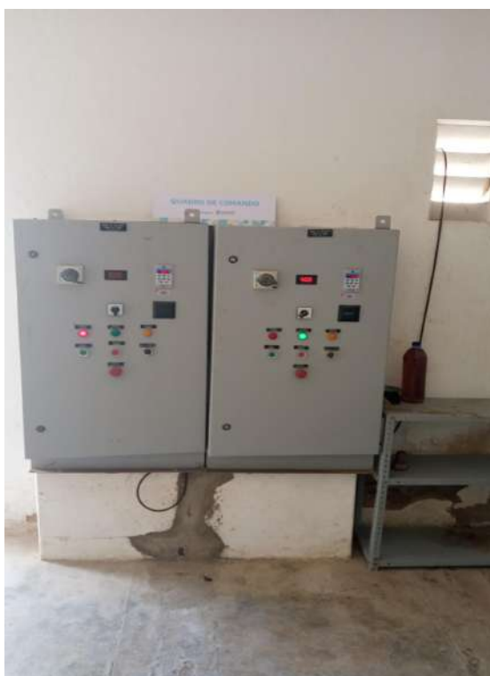
Foto 10 - EEAT-01: a estação elevatória tem fiação/cabos instalados de forma precária sem eletroduto, passando através de combogó.
