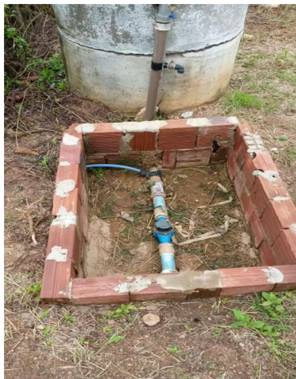
Foto 29 - PT-12: caixa de inspeção do macromedidor inacabada e sem tampa.
