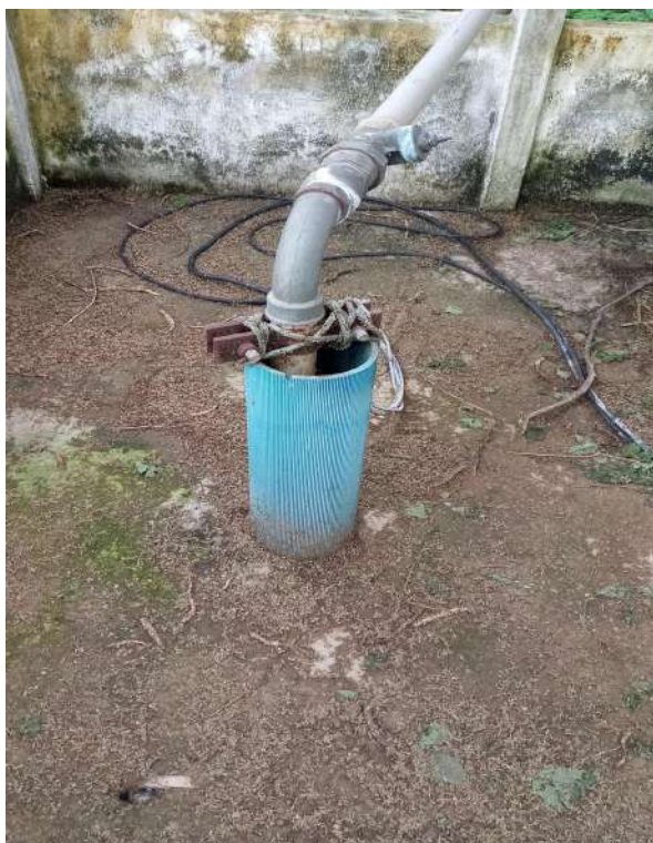
Foto 34 - PT-03: o poço encontra-se sem tampa e instalações elétricas precárias sobre o solo da área de circulação.
