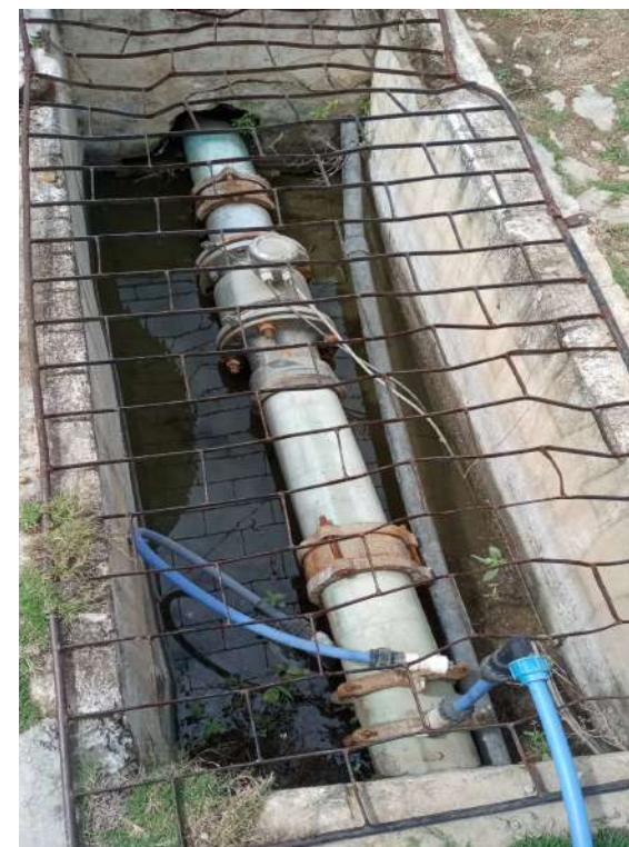
Foto 23 - Macromedidor: a caixa de proteção do macromedidor está acumulando água.
