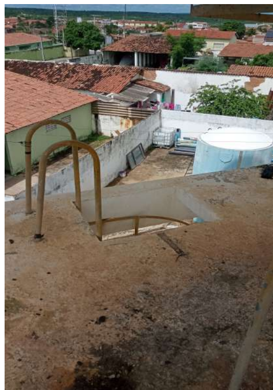
Foto 5 - REL-01: as lajes das plataformas de acesso não tem grades de proteção e a drenagem inadequada, acumulando água da chuva.
