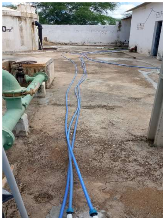
Foto 13 - Casa de Química: apresenta instalações hidráulicas de condução do tratamento químico (polímero e cloro) inadequadas com tubos instalados sobre o piso da área de circulação da ETA.
