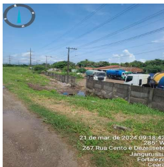
Foto 27 - ETE São Cristovão: muro danificado.
