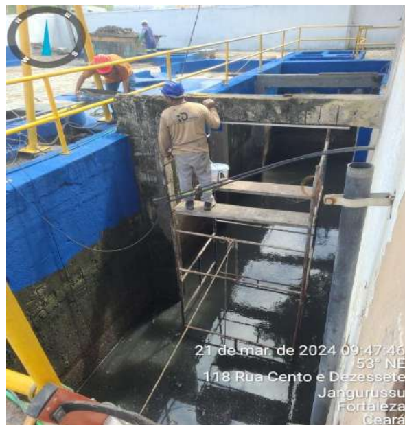
Foto 16 - Caixa de areia alagada.
