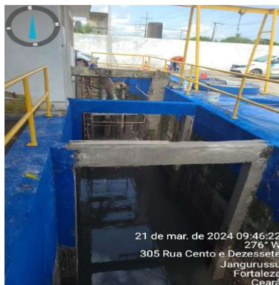
Foto 33 - ETE São Cristovão: caixa de areia alagada.
