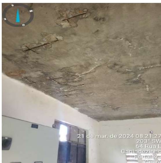
Foto 24 - ETE Parque Fluminense: Teto da casa de bomba com aço exposto.
