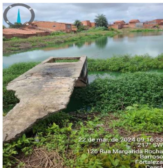
Foto 21 - ETE João Paulo II: laje da saída da lagoa deteriorada.
