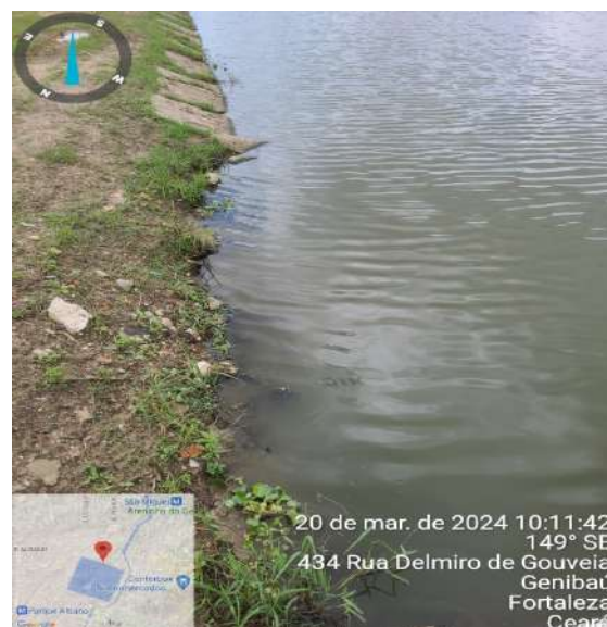
Foto 13 - ETE Conjunto Ceará: deslocamento dos taludes.
