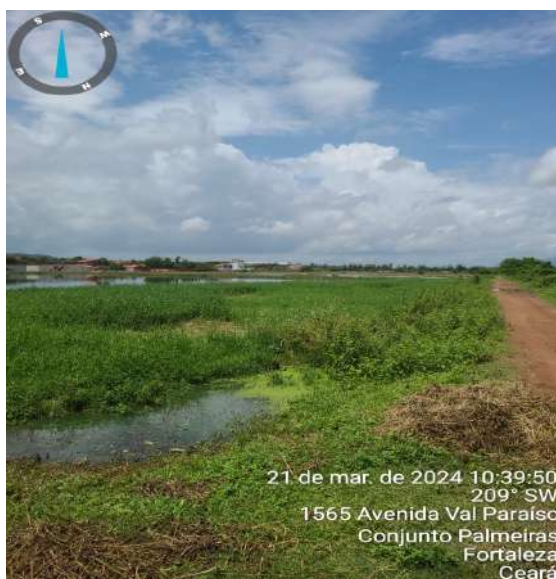
Foto 20 - ETE Conjunto Ceará: lagoa facultativa assoreada e com vegetação.
