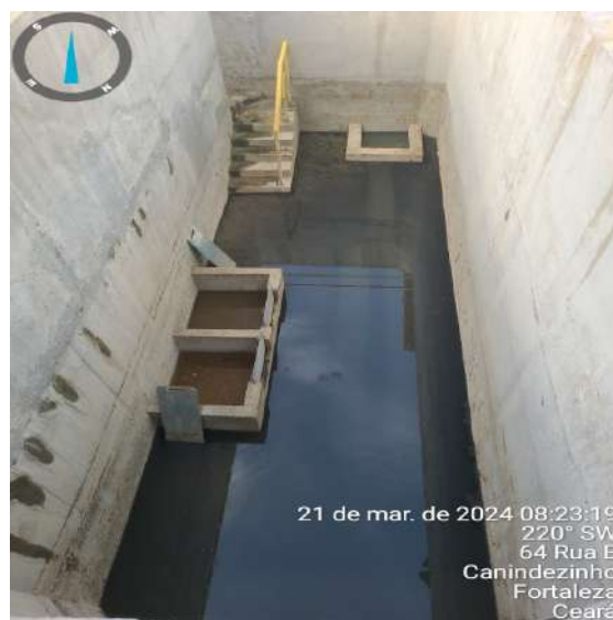
Foto 25 - ETE Parque Fluminense: área alagada.
