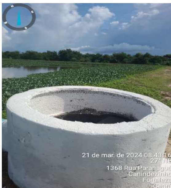
Foto 3 - ETE Conjunto Esperança: poço de recepção sem tampa.
