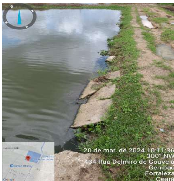
Foto 12 - ETE Conjunto Ceará: deslocamento dos taludes.
