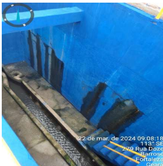
Foto 22 - Percolação de água na parede de contenção da área de tratamento preliminar.
