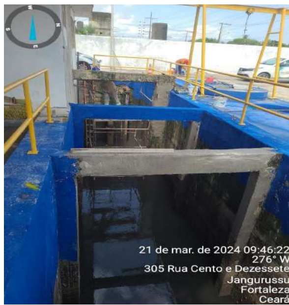
Foto 15 - Caixa de areia alagada.
