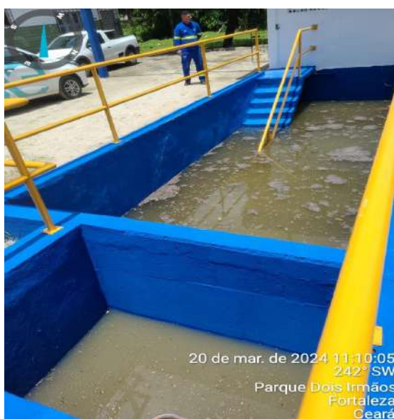
Foto 42 - ETE Tupã Mirim: área alagada.
