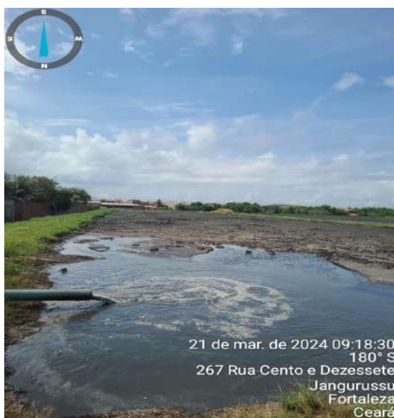
Foto 34 - ETE São Cristovão: lagoa assoreada.
