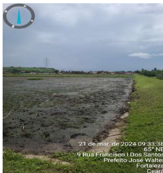
Foto 35 - ETE São Cristovão: lagoa assoreada.
