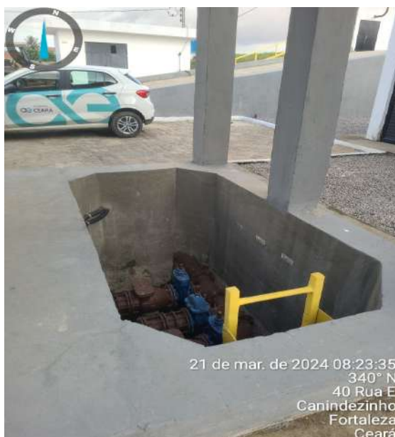
Foto 5 - ETE Parque Fluminense Ceará: ausência de guarda-corpo.
