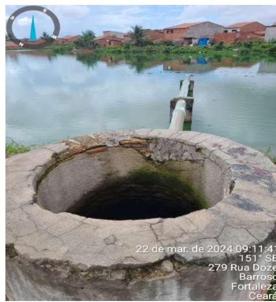
Foto 4 ETE Conjunto João Paulo II: poço de recepção sem tampa.
