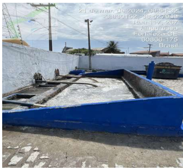
Foto 2 - Recebimento de efluentes dos veículos.
