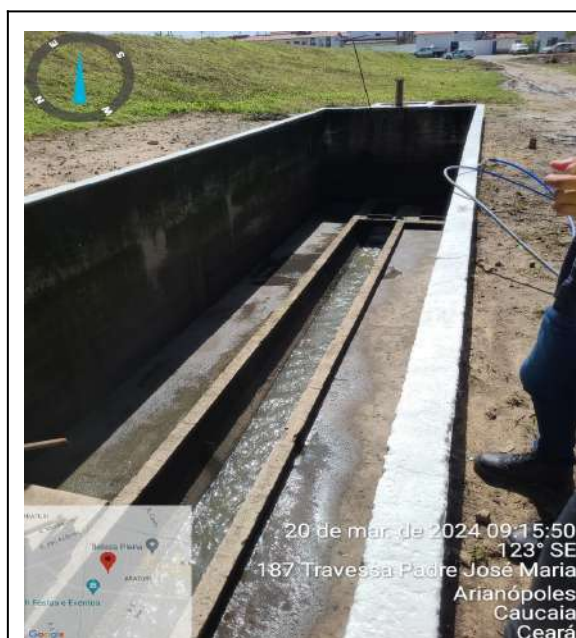
Foto 1 - ETE Araturi: ausência de guarda-corpo na área do tratamento preliminar.
