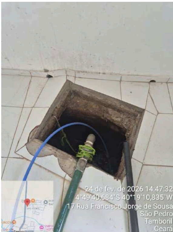
Foto 25 - EERD-01 (Booster Prefeitura - Sede): ausência de identificação; sem tampa; fiação sem eletroduto.
