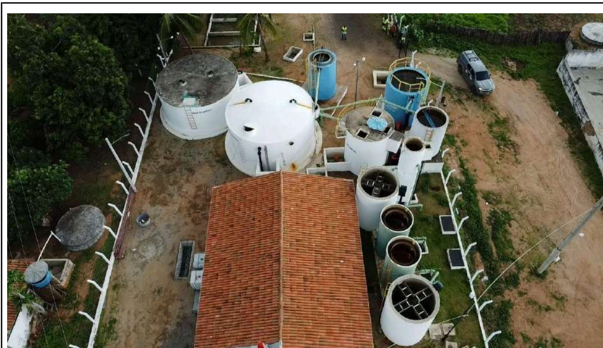
Foto 1 - ETA Tamboril / Filtros: F-01, F-03 e F-04 sem tampas.
