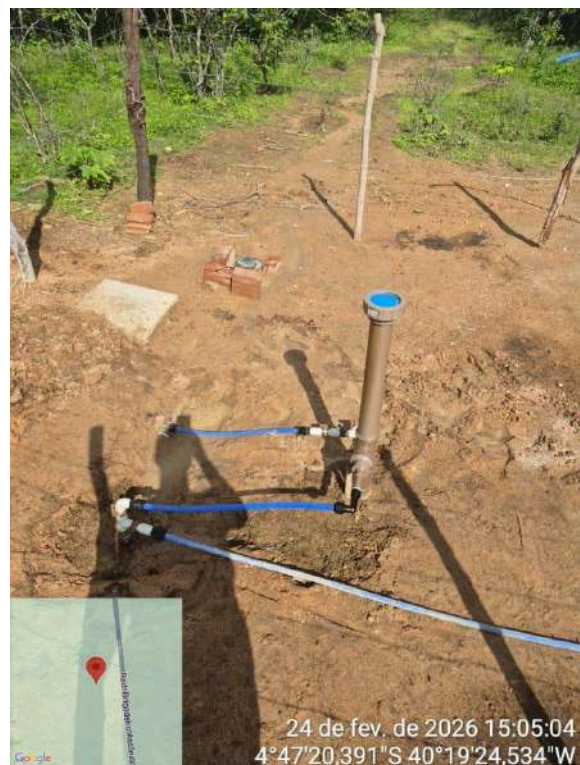
Foto 28 - PT-31 (Sede): sem proteção de intempéries.
