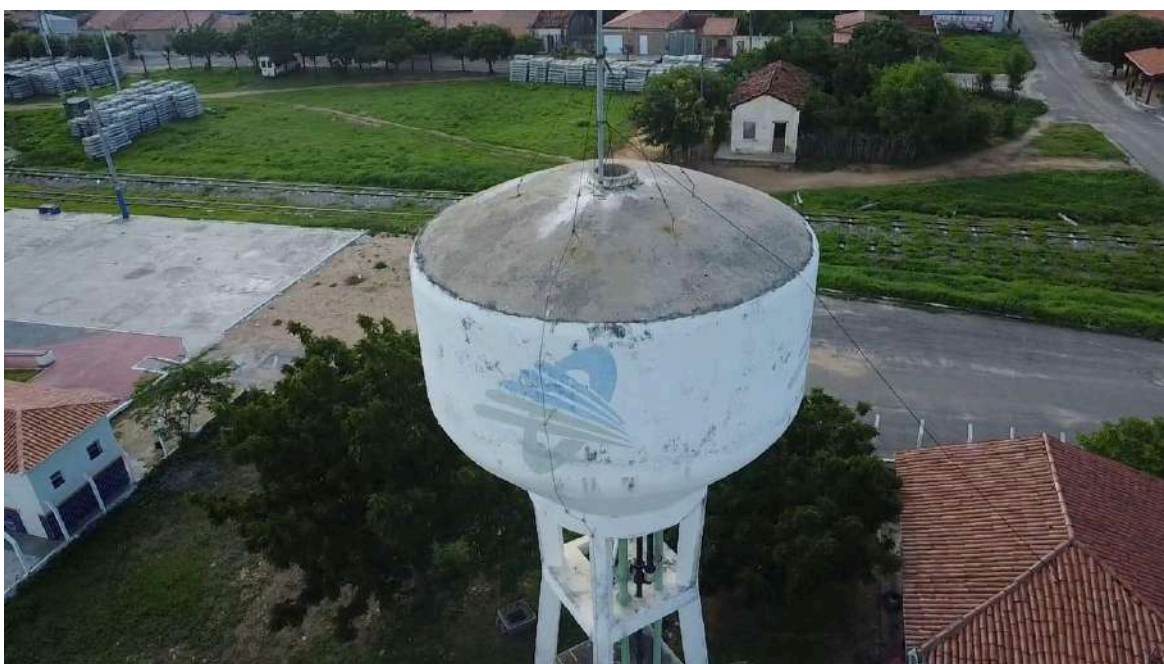
Foto 38 - REL-01 (Sucesso): pintura desgastada.
