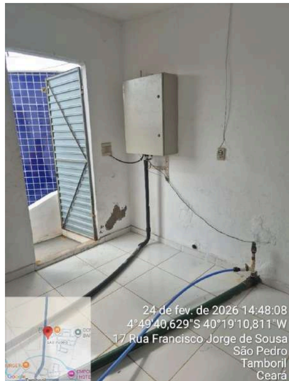
Foto 26 - EERD-01 (Booster Prefeitura - Sede): ausência de identificação; sem tampa; fiação sem eletroduto.
