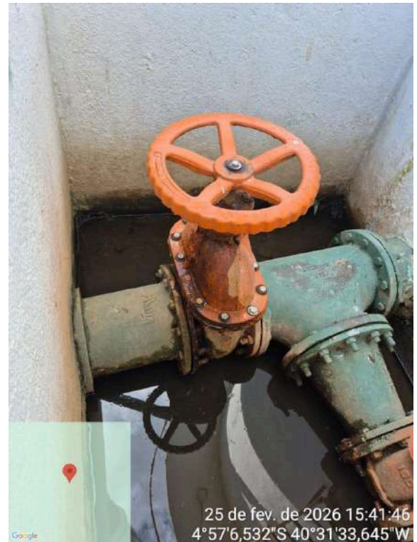
Foto 34 - ETA Sucesso: válvula com vazamento.
