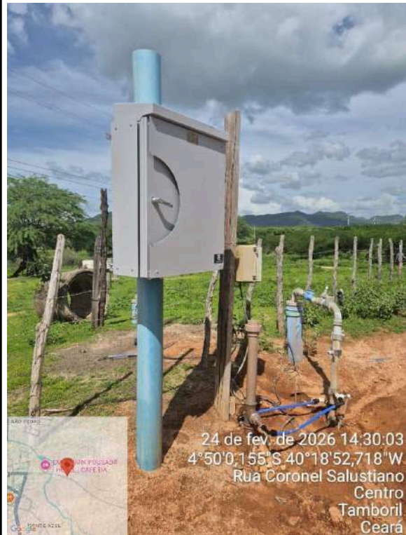
Foto 4 - SAA / PT-22 (Sede): ausência de identificação e cerca de proteção/isolamento.
