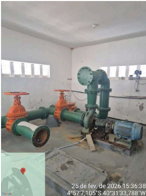
Foto 33 - ETA Sucesso: ausência de bomba reserva de lavagem dos filtros.
