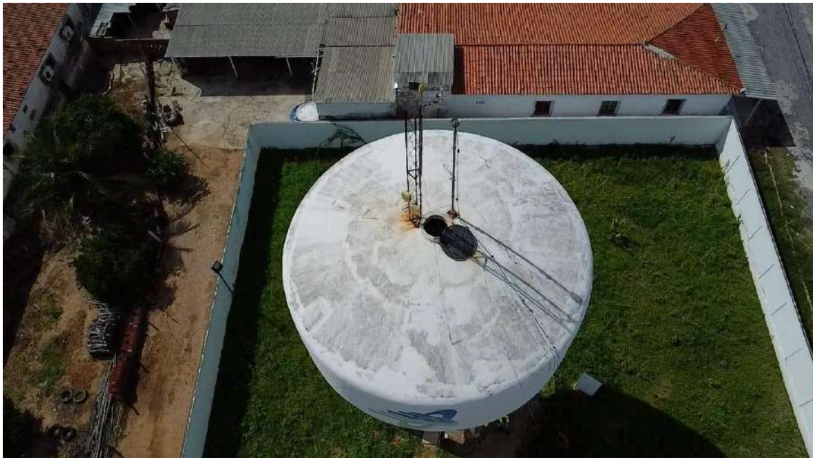
Foto 18 - REL-02 (Sede): tampa deslocada.
