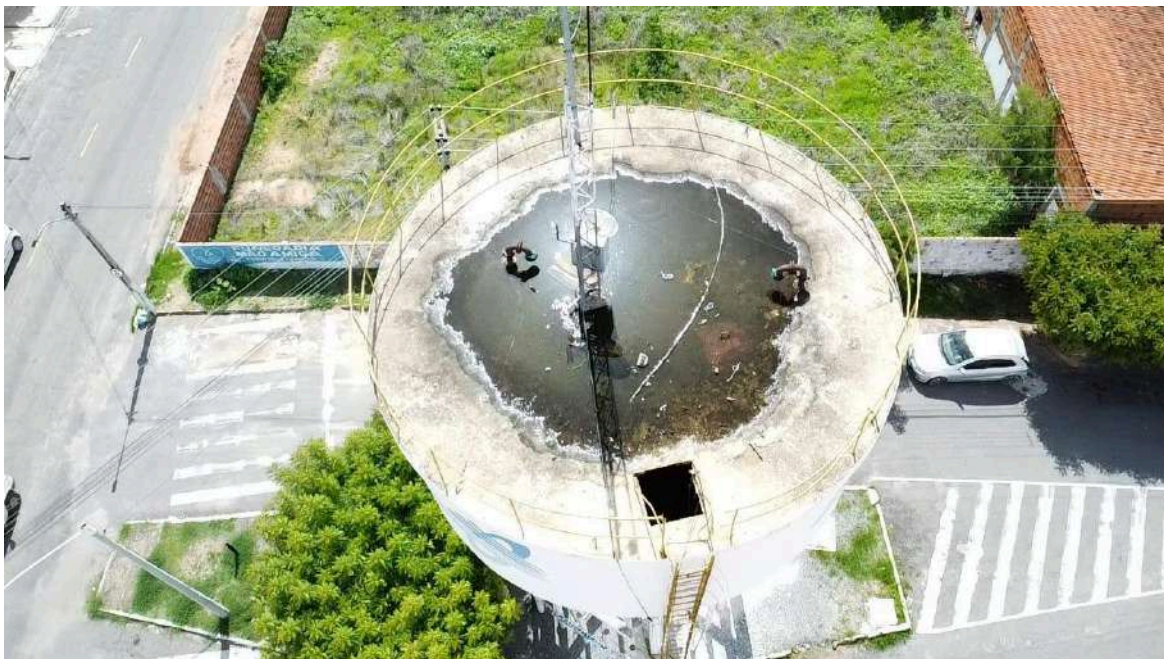
Foto 5 - REL-01 (Sede): sem tampa e com acúmulo de água na laje.
