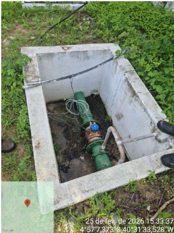
Foto 29 - ETA Sucesso: caixas sem grade de proteção.
