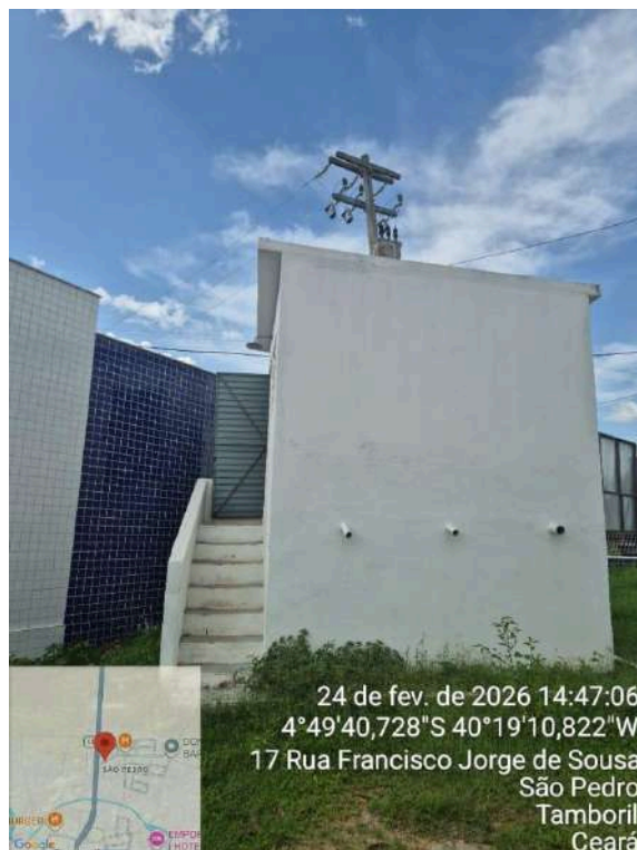
Foto 24 - EERD-01 (Booster Prefeitura - Sede): ausência de identificação; sem tampa; fiação sem eletroduto.
