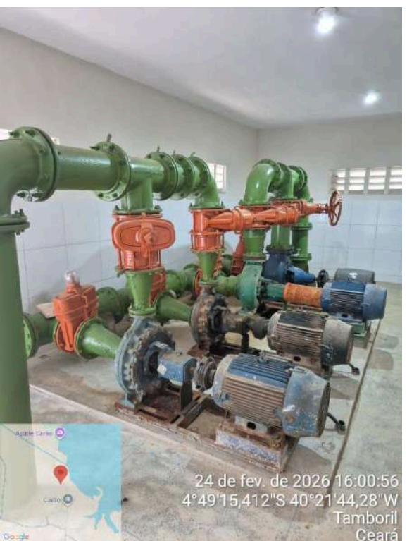
Foto 11 - ETA Tamboril: casa de bombas com equipamentos oxidados.
