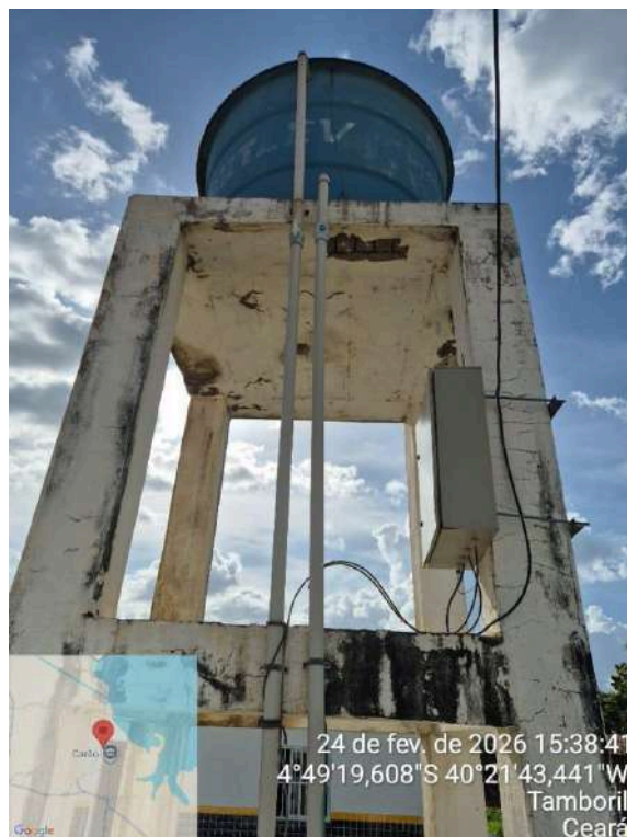
Foto 22 - REL-04 (Sede): sem identificação; pilares de sustentação da caixa d'água apresenta rachaduras e defeitos na estrutura.
