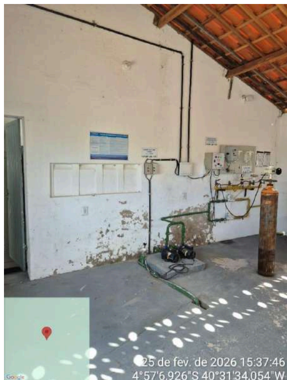
Foto 32 - ETA Sucesso: casa de química com piso e parede desgastados.
