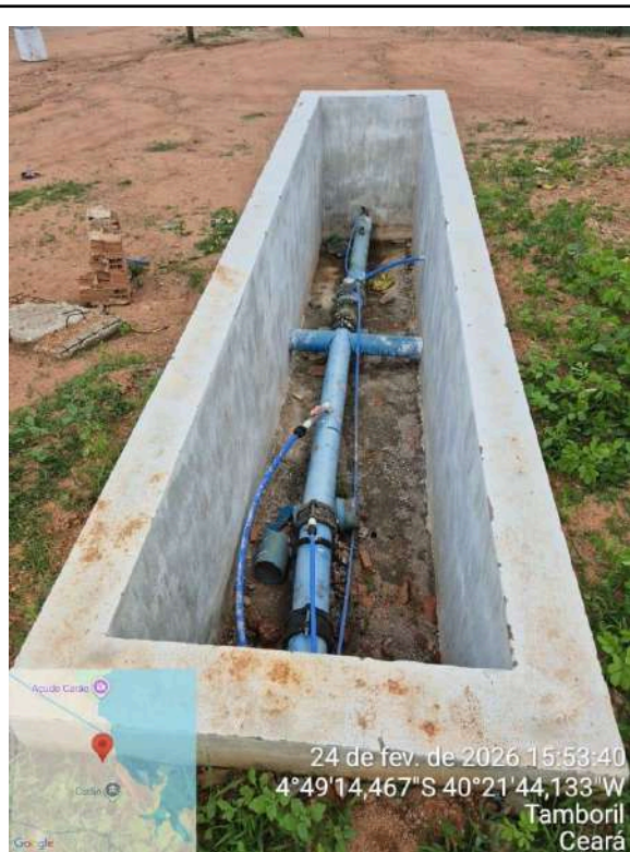
Foto 9 - ETA Tamboril: caixa de entrada sem grade de proteção.
