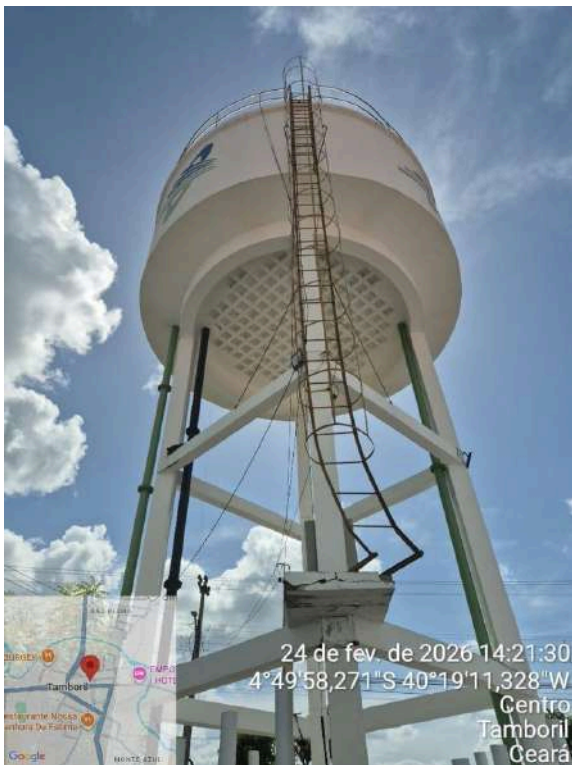
Foto 15 - REL-01 (Sede): sem isolamento adequado; escada danificada, com fiação presa no guarda-corpo.
