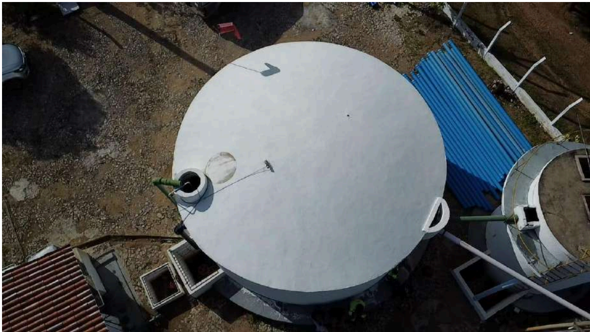
Foto 6 - RAP-01 (Sucesso): sem tampa de inspeção.
