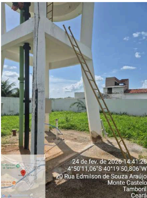
Foto 19 - REL-02 (Sede): escada inadequada, sem fixação.
