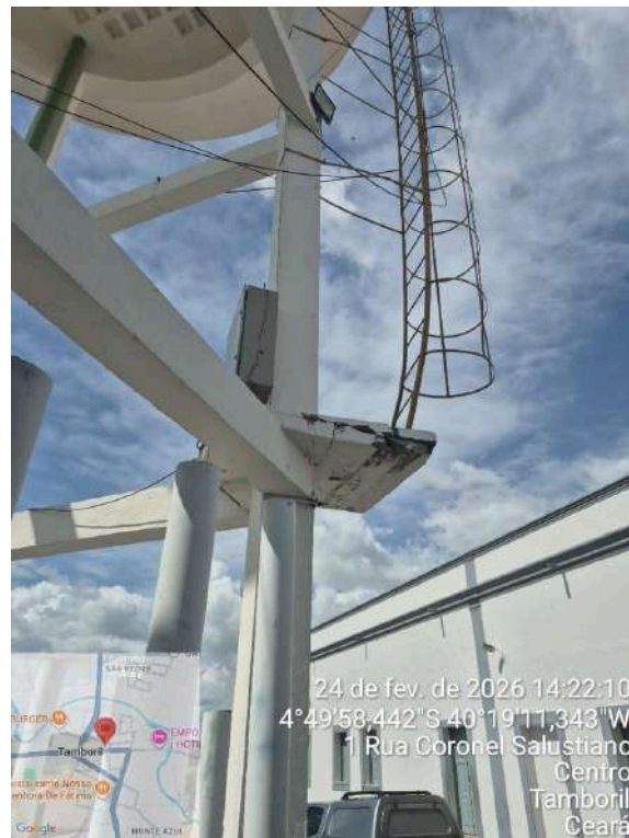
Foto 16 - REL-01 (Sede): sem isolamento adequado; escada danificada, com fiação presa no guarda-corpo.
