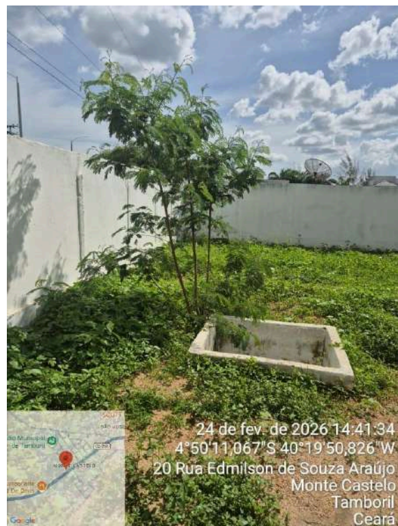
Foto 20 - REL-02 (Sede): caixa do registro sem grade de proteção; vegetação no entorno.
