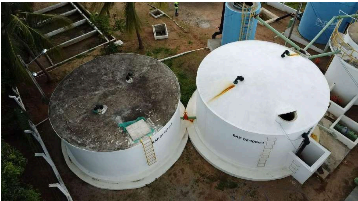
Foto 14 - ETA Tamboril: RAP-02 com tampa quebrada e abertura superior.
