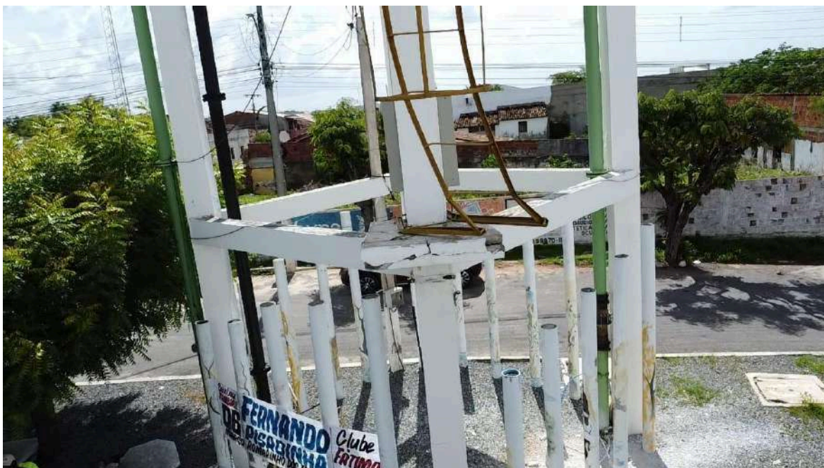
Foto 17 - REL-01 (Sede): sem isolamento adequado; escada danificada, com fiação presa no guarda-corpo.
