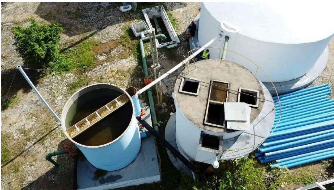
Foto 37 - ETA Sucesso: Filtros F-01 e F-02 com tampas deslocadas e rachaduras.
