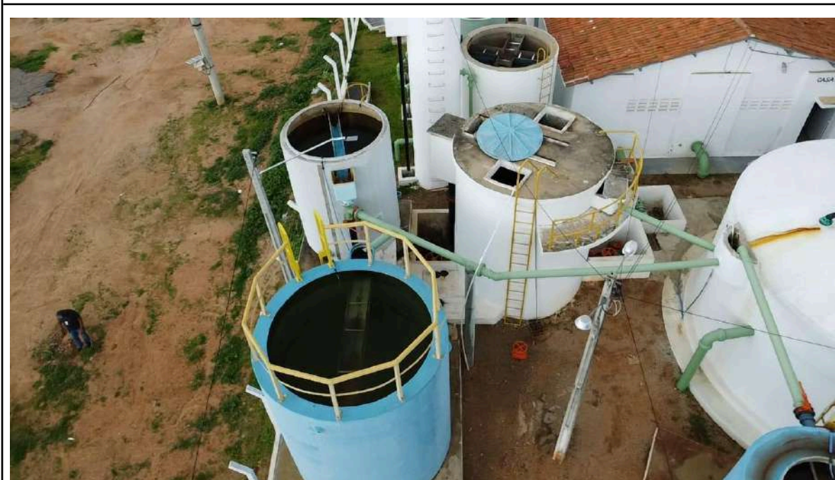
Foto 2 - ETA Tamboril: Filtros F-01, F-03 e F-04 sem tampas.
