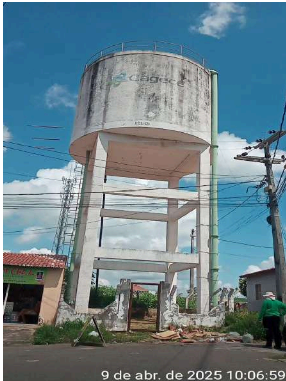
Foto 25 - REL-01: infraestrutura com pintura desgastada e logomarca com visibilidade prejudicada.
