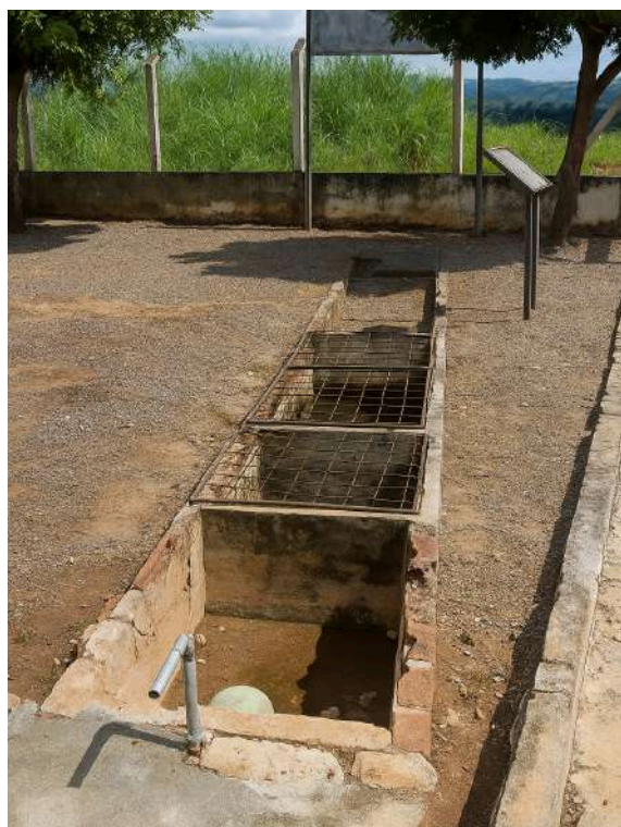
Foto 5 - ETA: caixa sem tampa ou grade de proteção.
