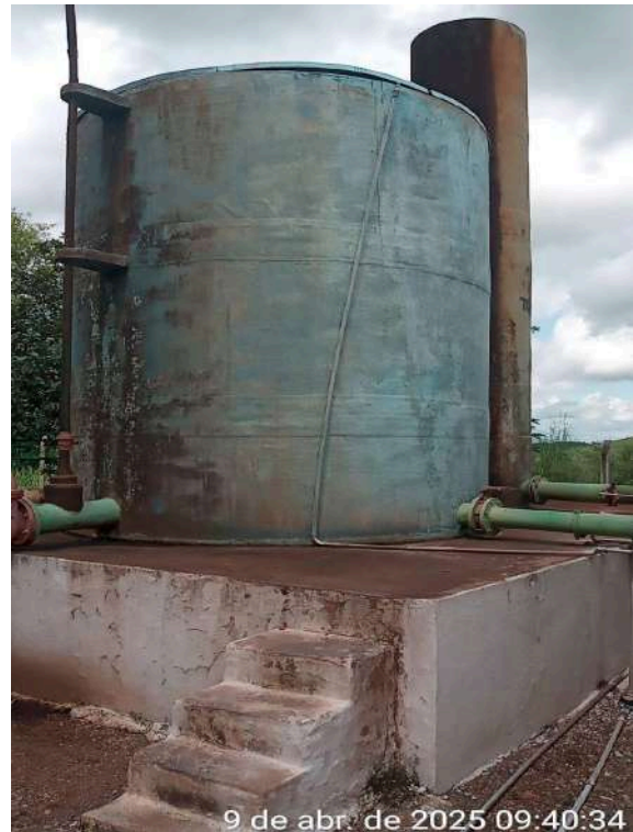
Foto 28 - ETA: a escada de acesso e a plataforma do filtro não têm guarda corpo (corrimão).
