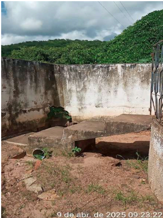
Foto 27- Captação: escada de acesso à casa de bombas não tem guarda corpo (corrimão).
