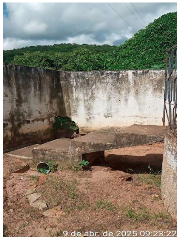
Foto 14 - Captação: infraestrutura com pintura deteriorada.
