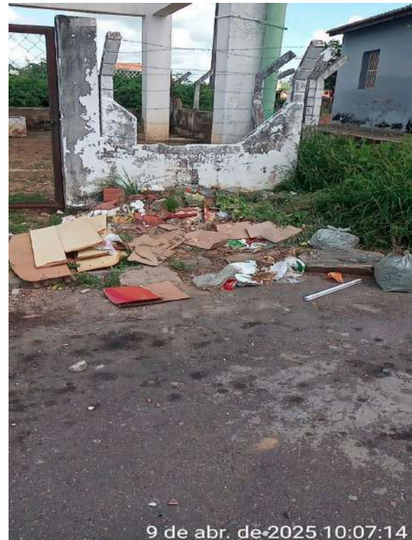
Foto 26 - REL-01: infraestrutura com pintura desgastada e logomarca com visibilidade prejudicada; há ponto de lixo próximo ao reservatório.
