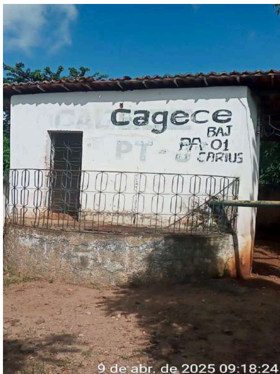
Foto 13 - Captação: infraestrutura com pintura deteriorada.
