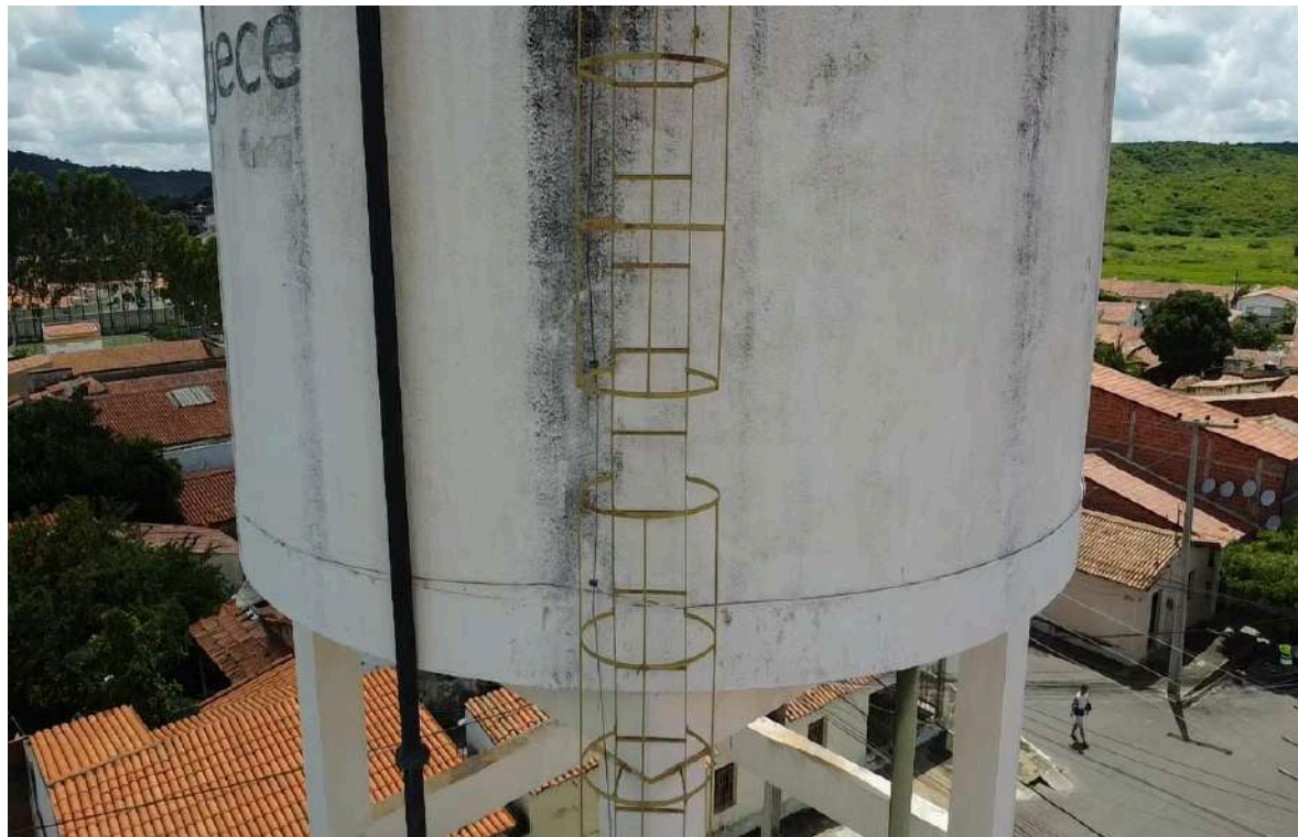
Foto 9 - REL-01: o cabo de para-raios está inadequado, instalado junto à escada.
