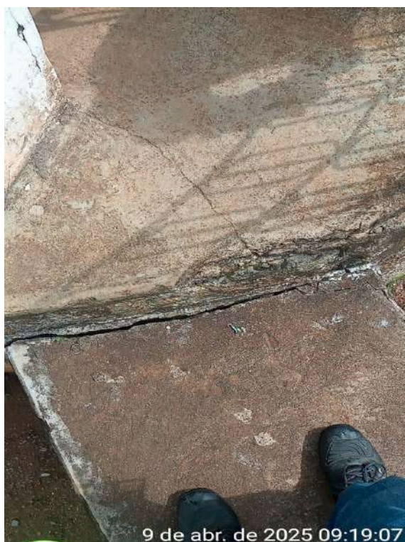
Foto 15 - Captação: escada de acesso à casa de bombas apresenta rachaduras
