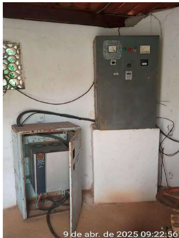
Foto 2 - Captação: instalações elétricas inadequadas com cabos/fios sem eletrodutos de isolamento e proteção, e instalados sobre o piso da área de circulação, bem como não tem iluminação.
