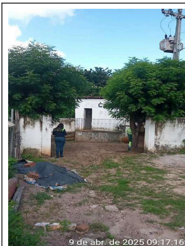
Foto 1 - Captação: acesso da área de proteção e isolamento está sem portão.
