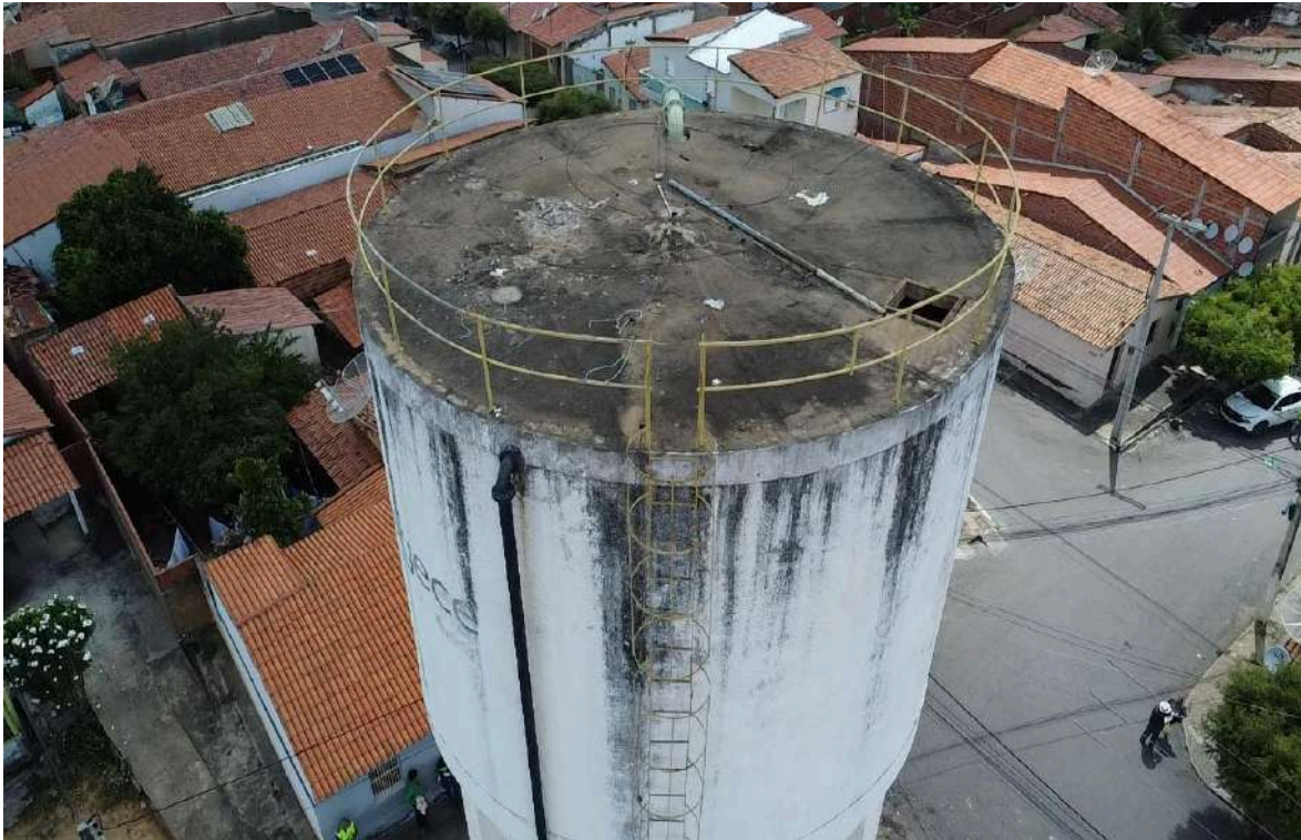
Foto 10 - REL-01: a abertura de inspeção do reservatório está sem tampa.
