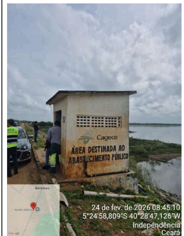
Foto 3 - EECS-02: pintura deteriorada.
