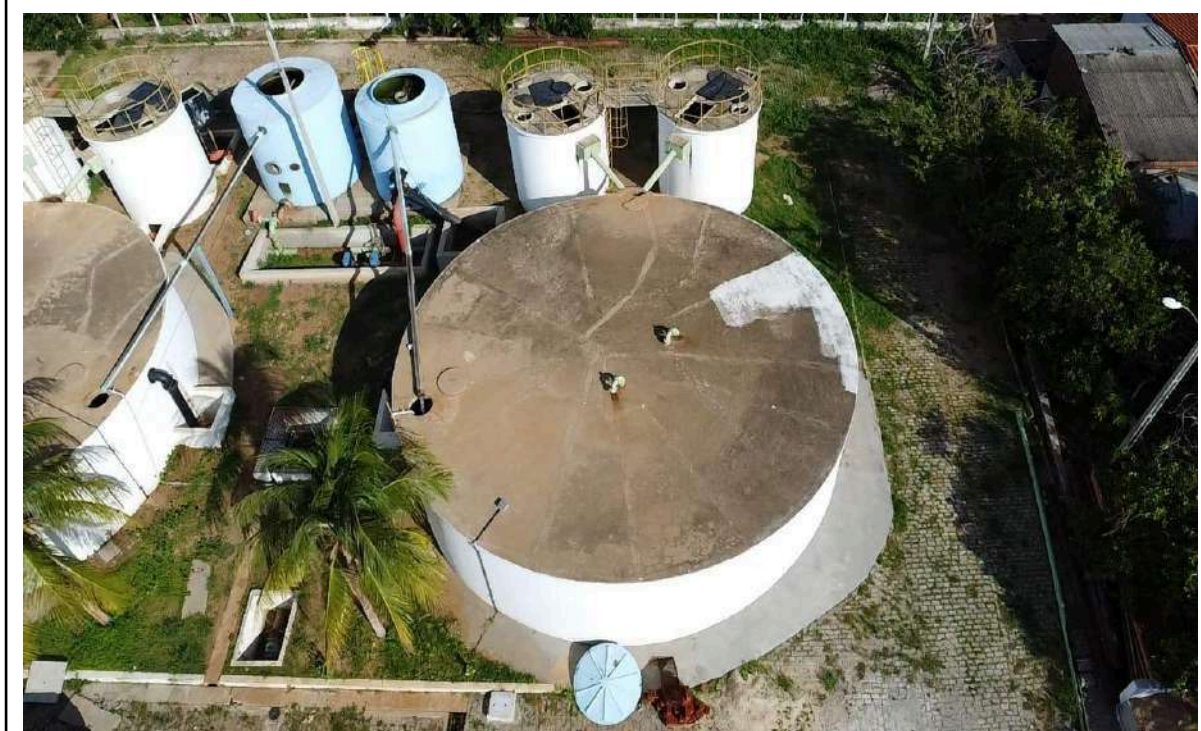
Foto 25 - RAP-01 / RAP-02: tampa de inspeção deslocada.
