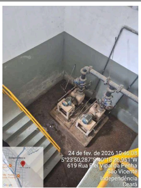
Foto 47 - Casa de bombas: bombas desativadas e com base inadequada.
