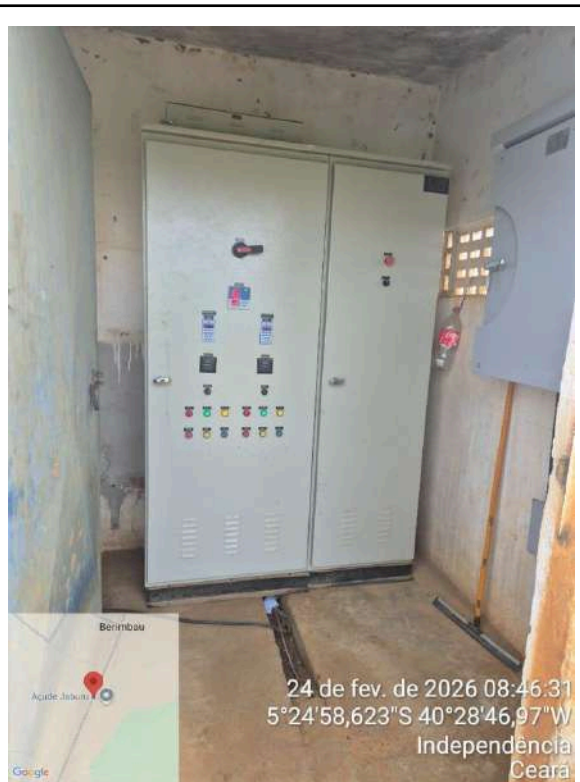
Foto 2 - EECS-02: pintura deteriorada.
