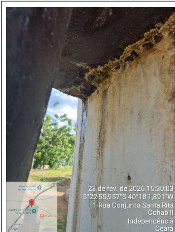
Foto 12 - F-02 / F-03 / F-04: pintura desgastada; tampa deslocada e presença de vazamento no filtro.
