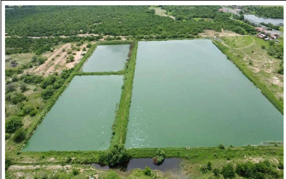
Foto 39 - Lagoa facultativa: presença de zona morta; caixa de passagem danificada; placas de isolamento danificadas.
