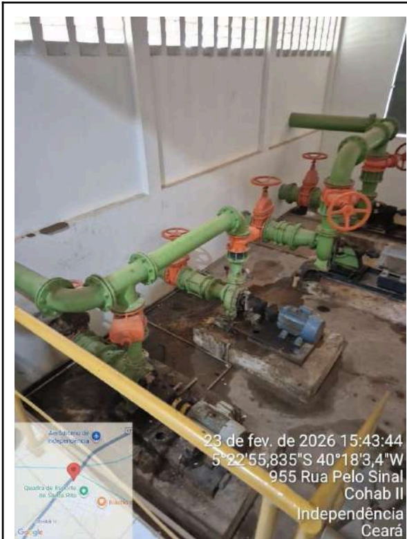
Foto 15 - EEAT-01/EELF-01: as quatro bombas estão oxidadas; presença de vazamento nas bombas 1, 2 e 3.
