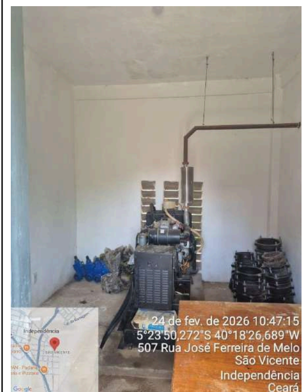
Foto 48 - Casa de bombas: gerador sem funcionar.
