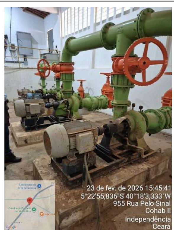
Foto 16 - EEAT-01/EELF-01: as quatro bombas estão oxidadas; presença de vazamento nas bombas 1, 2 e 3.
