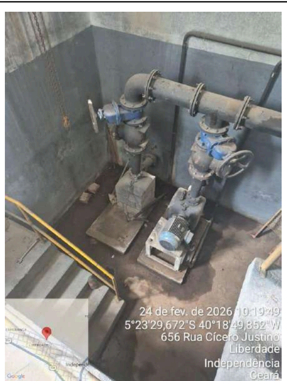
Foto 43 - Casa de bombas: ausência de bomba reserva e base da bomba inadequada.
