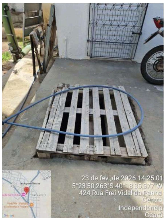
Foto 29 - REL-01: caixa de registro com fechamento de madeira.
