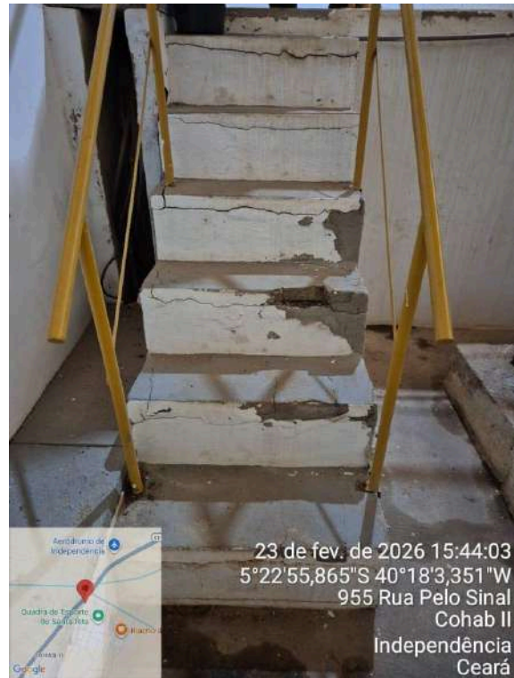
Foto 20 - EEAT-01/EELF-01: escada de acesso com degraus danificados/rachados e corrimão sem fixação adequada.
