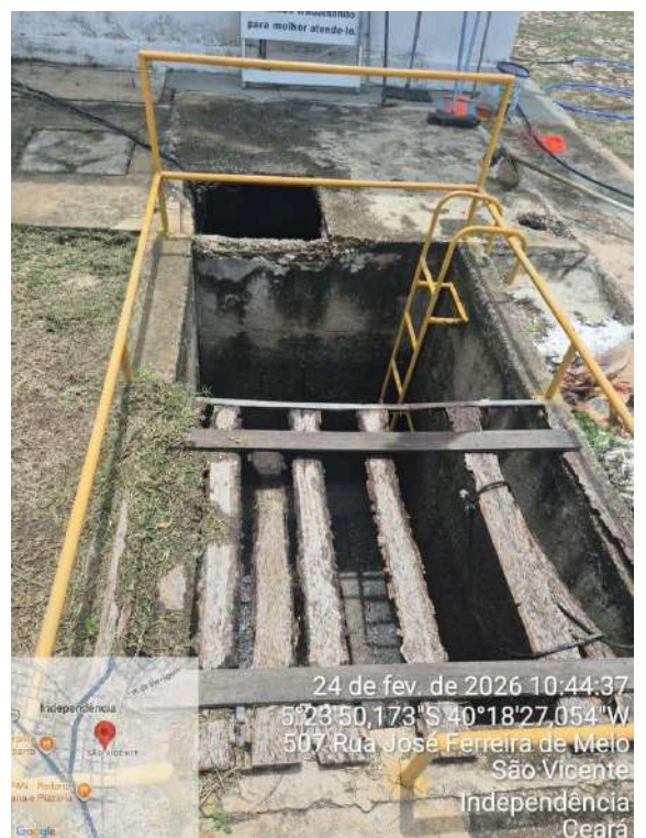
Foto 45 - Tratamento preliminar: ausência de tampa de proteção.
