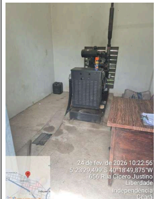
Foto 44 - Piso da sala do gerador danificado.
