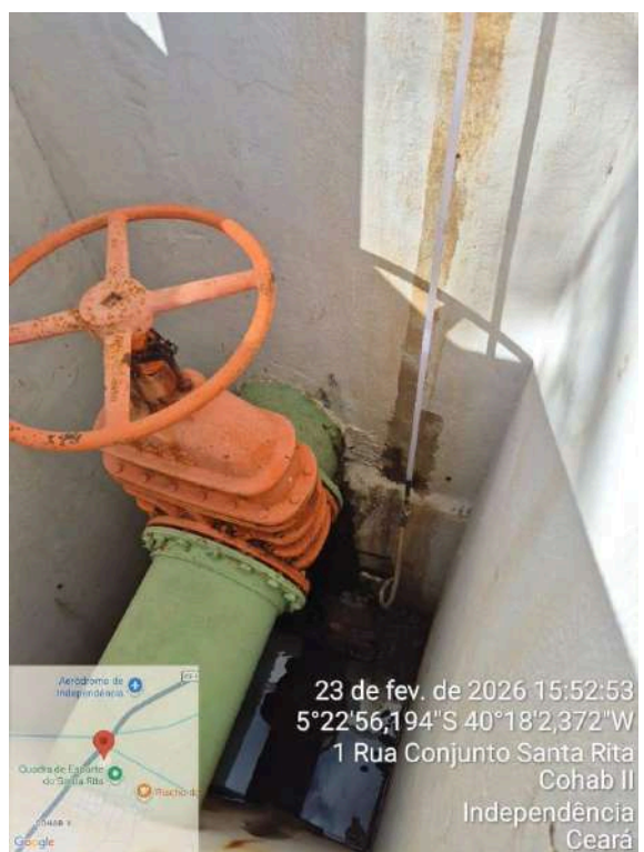
Foto 4 - ETA / Geral: caixa do registro de entrada sem grade de proteção.
