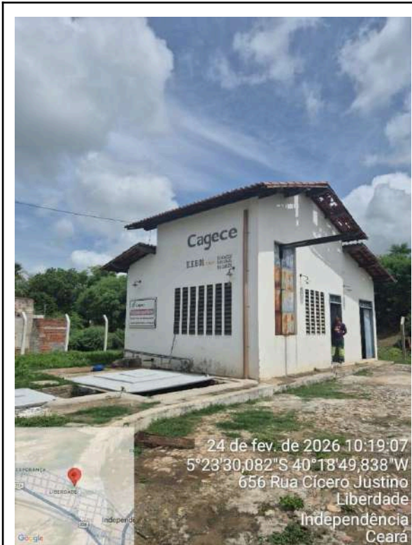
Foto 42 - Geral: muro e cerca de isolamento danificados; vegetação no entorno; telhado externo danificado.
