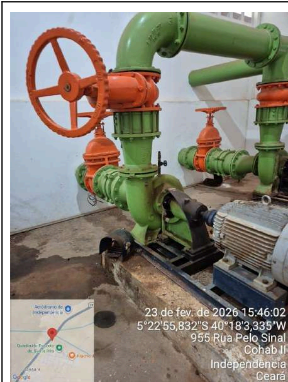
Foto 19 - EEAT-01/EELF-01: as quatro bombas estão oxidadas.
