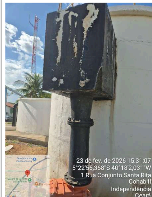
Foto 10 - F-02 / F-03 / F-04: pintura desgastada; tampa deslocada e presença de vazamento no filtro.
