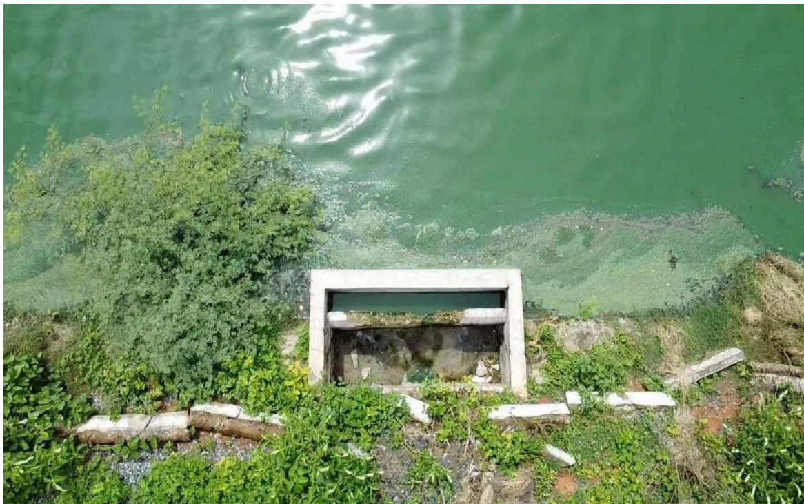
Foto 37 - Lagoa facultativa: presença de zona morta; caixa de passagem danificada; placas de isolamento danificadas.
