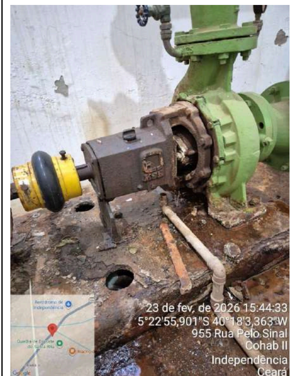
Foto 17 - EEAT-01/EELF-01: as quatro bombas estão oxidadas; presença de vazamento nas bombas 1, 2 e 3.
