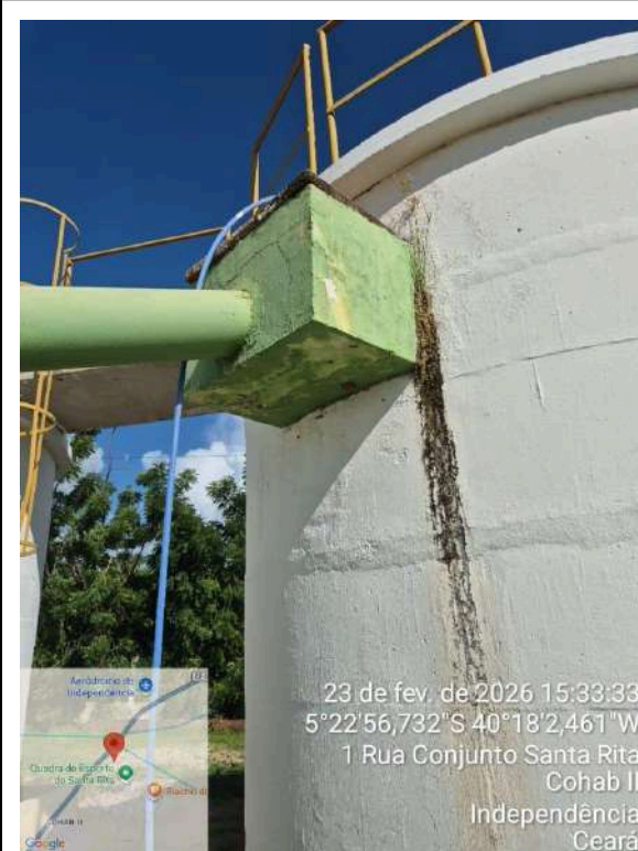
Foto 7 - F-01: pintura desgastada e presença de vazamento no filtro e na estrutura.
