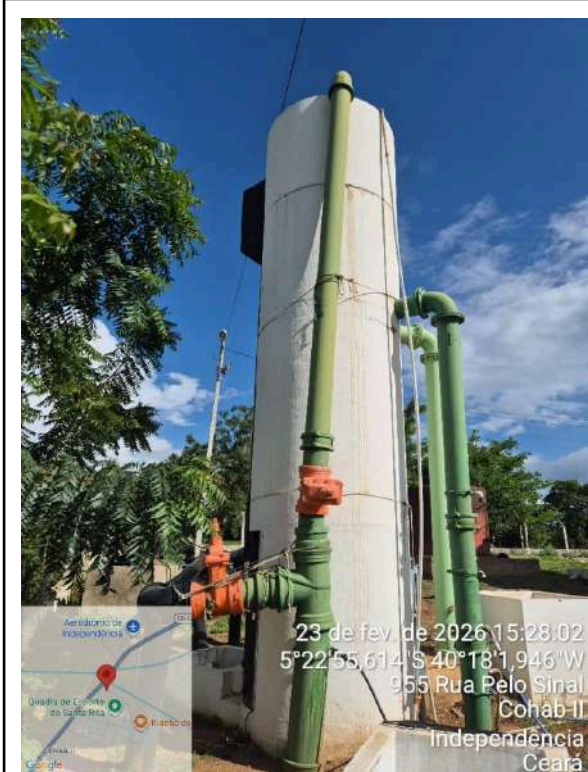
Foto 6 - Torre de nível: tubulação sustentada por cordas.
