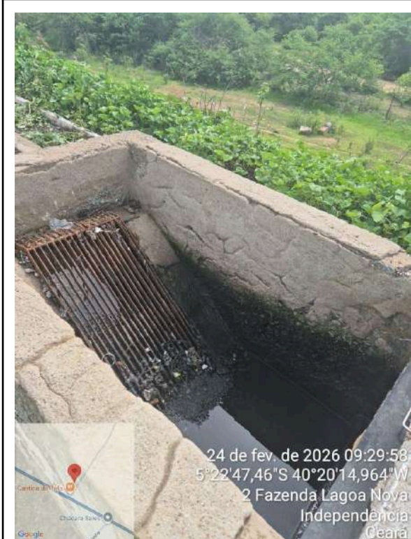
Foto 31 - Grade: estrutura deteriorada.
