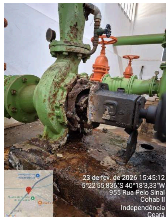
Foto 18 - EEAT-01/EELF-01: as quatro bombas estão oxidadas; presença de vazamento nas bombas 1, 2 e 3.
