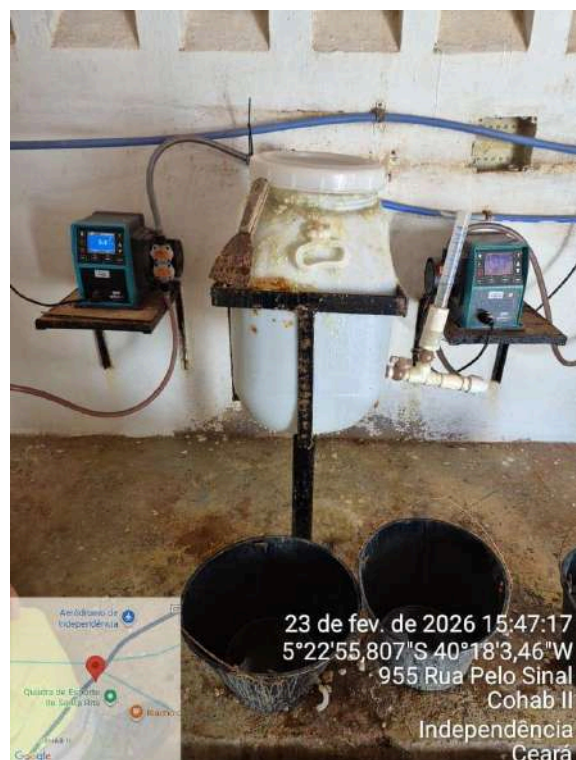
Foto 22 - Casa de química: bombona do produto químico com acúmulo de resíduo.
