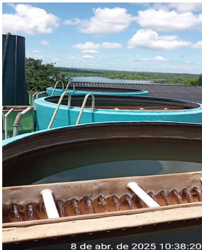
Foto 9 - ETA: Ausência de tampas nos filtros.
