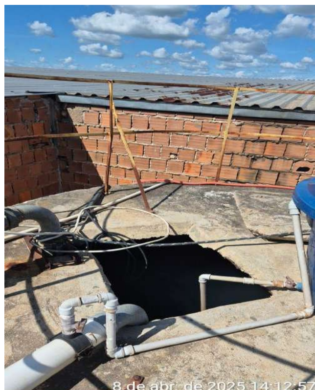
Foto 53 - RSE-01: Tampa deslocada; fiação inadequada.
