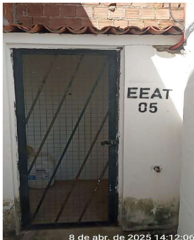
Foto 49 - EEAT-05: Parede com rachaduras.
