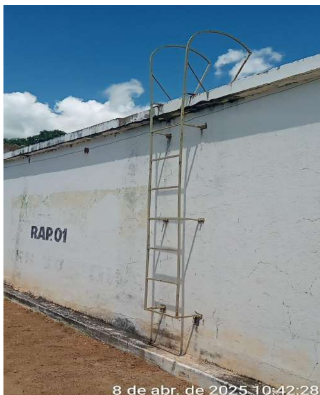
Foto 64 - RAP-01: reservatório sem grade de proteção / guarda corpo.
