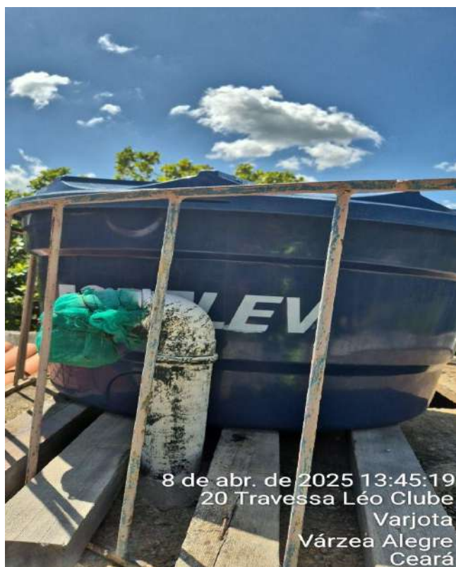
Foto 44 - RAP-04: Guarda-corpo com pintura desgastada.
