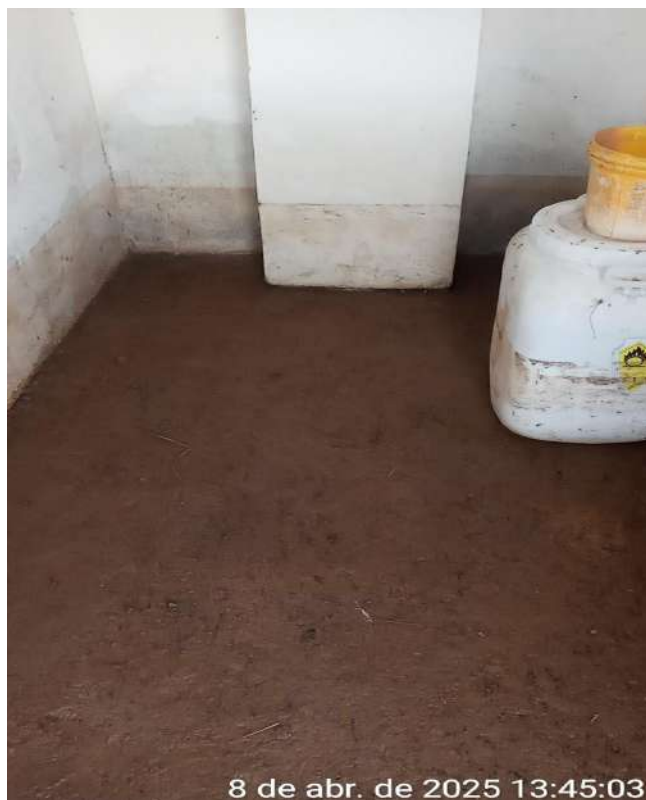
Foto 42 - EEAT-03: Piso da área interna com sujeira/lama acumulada.
