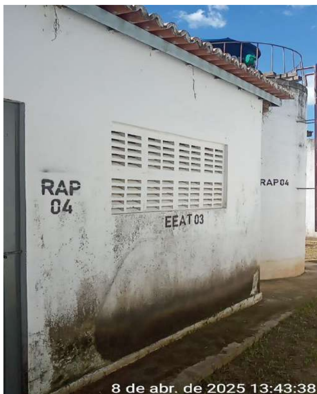
Foto 40 - EEAT-03: Pintura desgastada.
