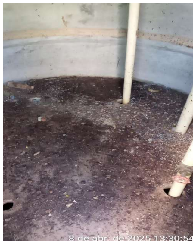
Foto 37 - REL-04: Área interna do fuste apresenta sujeira acumulada no piso e cupins nas paredes.
