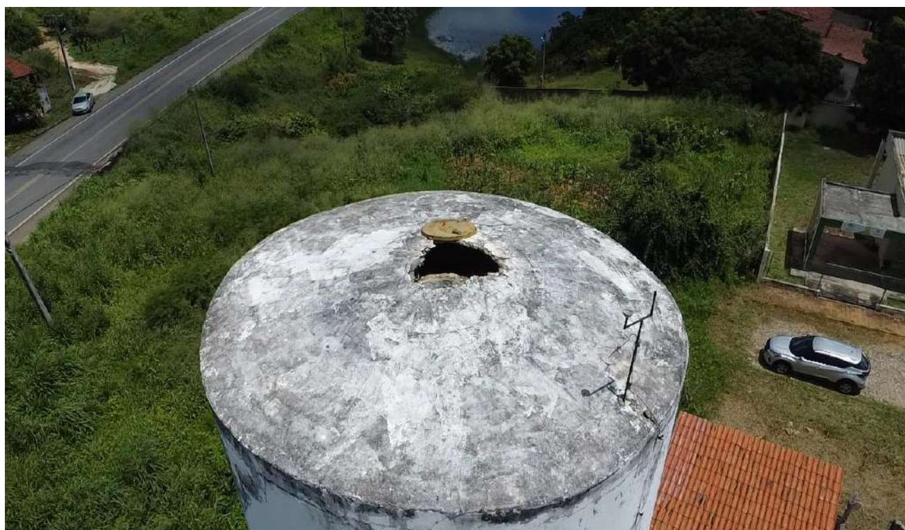
Foto 34 - REL-02: Laje superior com falha na estrutura, comprometendo o fechamento hermético.
