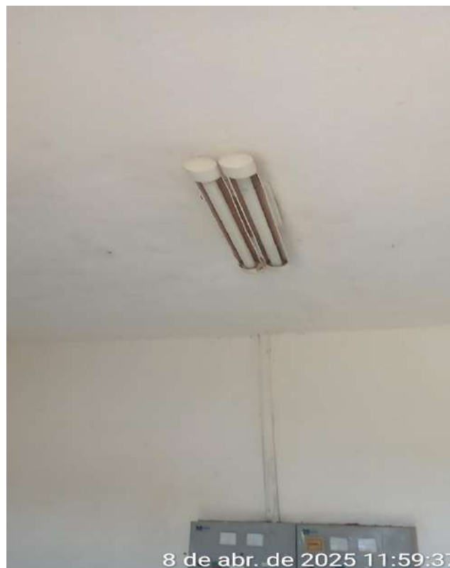
Foto 33 - EEAT-02: Lâmpada queimada.
