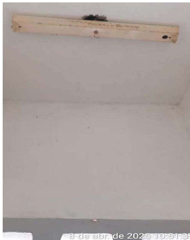
Foto 2 - ETA: Banheiro sem iluminação.
