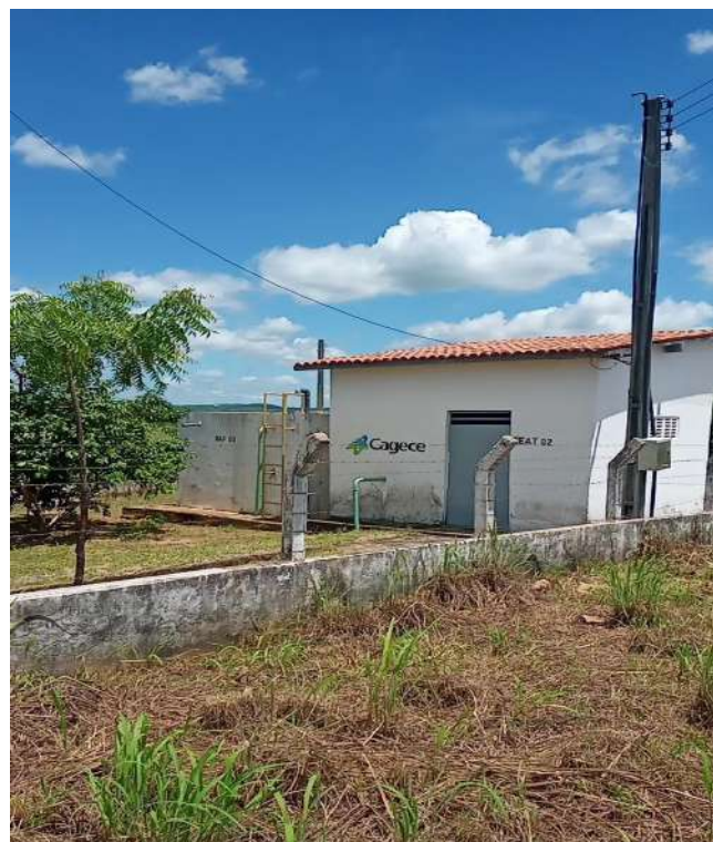
Foto 29 - RAP-03 / REL-02 / EEAT-02: Pintura deteriorada e cerca de proteção e isolamento danificada.
