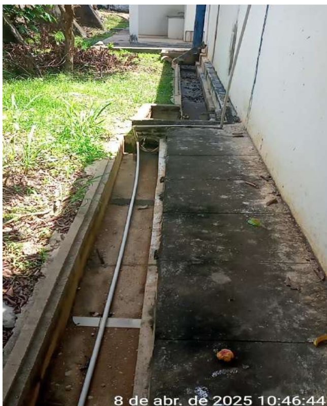
Foto 7 - ETA: Calha de drenagem com grade de proteção danificada e/ou sem grade.
