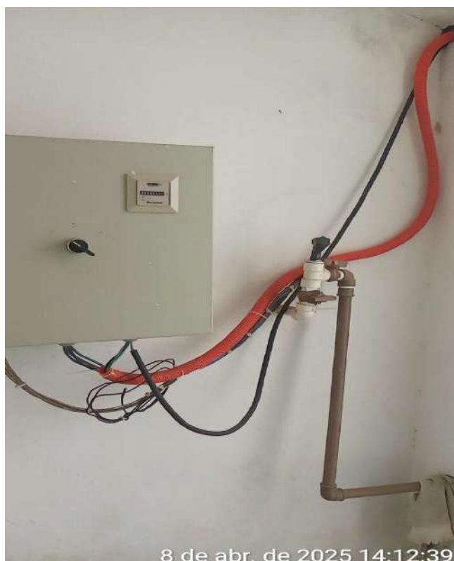
Foto 52 - EEAT-05: Fios/cabos elétricos sem eletrodutos de proteção e isolamento.
