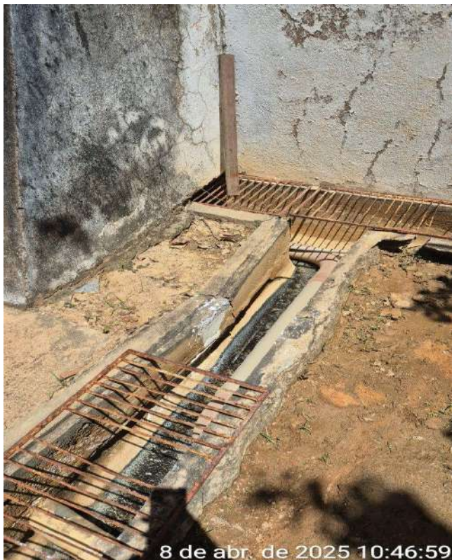
Foto 5 - ETA: Calha de drenagem com grade de proteção danificada e/ou sem grade.
