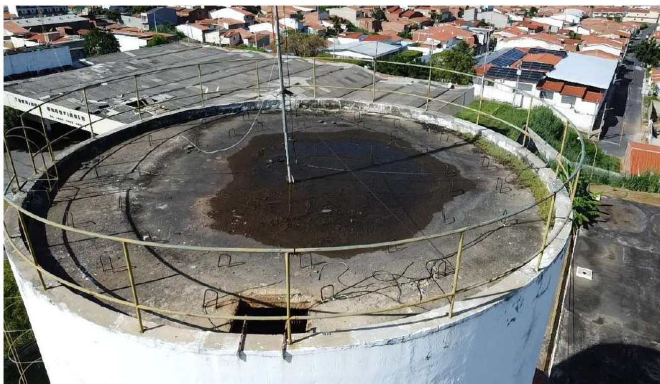
Foto 25 - REL-01: Ausência de tampa de inspeção com fecho hermético; fios/cabos inadequados.
