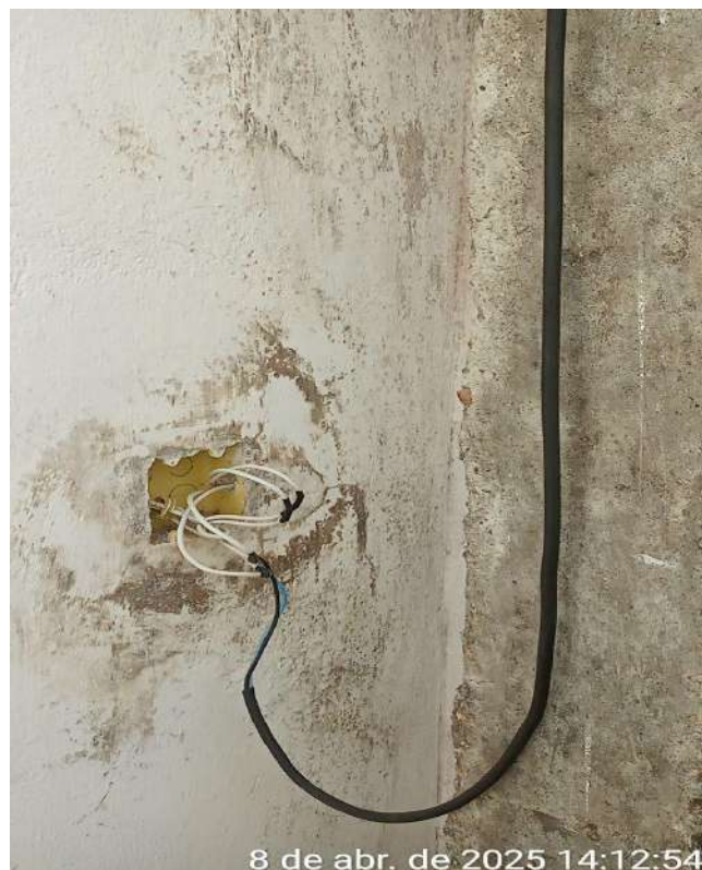
Foto 51 - EEAT-05: Fios/cabos elétricos sem eletrodutos de proteção e isolamento.
