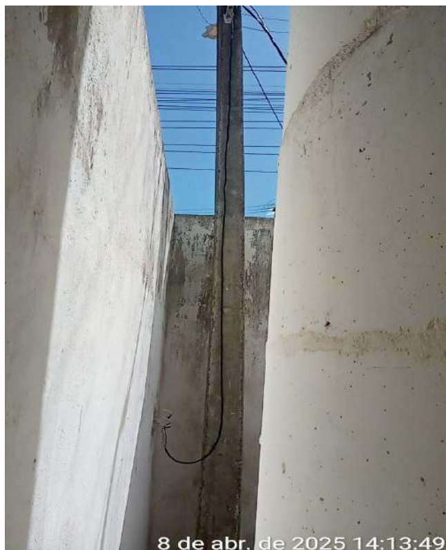
Foto 50 - EEAT-05: Fios/cabos elétricos sem eletrodutos de proteção e isolamento.
