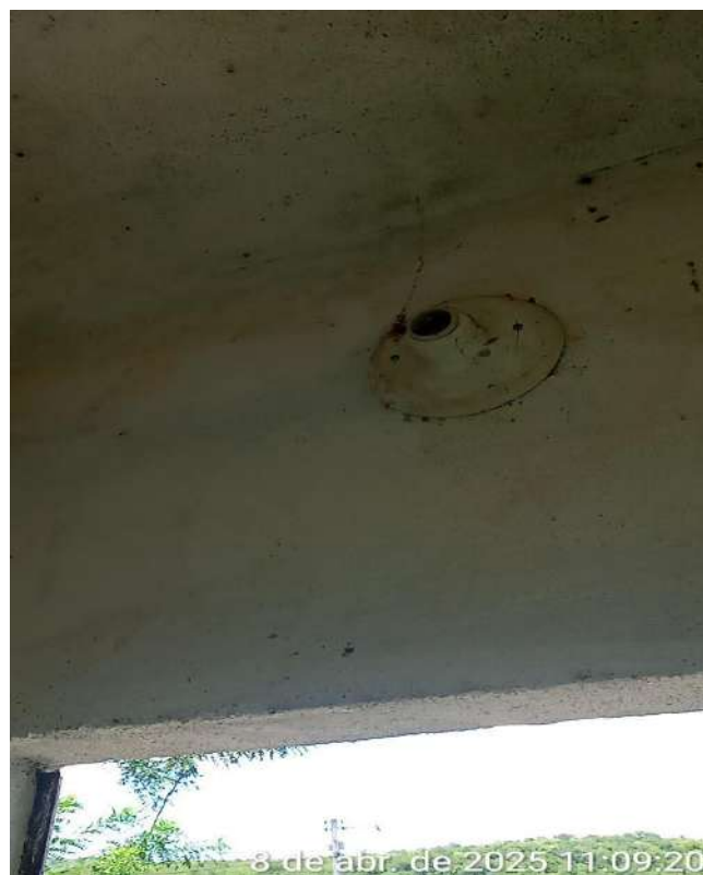
Foto 12 - ETA/ETRG: Ausência de lâmpada na casa do quadro de comando.
