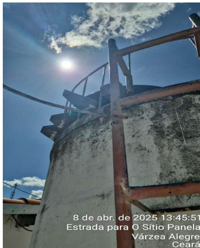
Foto 43 - RAP-04: Escada oxidada; guarda-corpo danificado.
