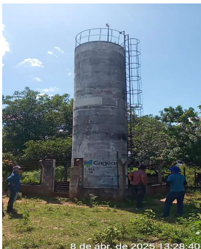
Foto 36 - REL-04: Muro e reservatório com pintura desgastada; trancas dos portões com fechos defeituosos.
