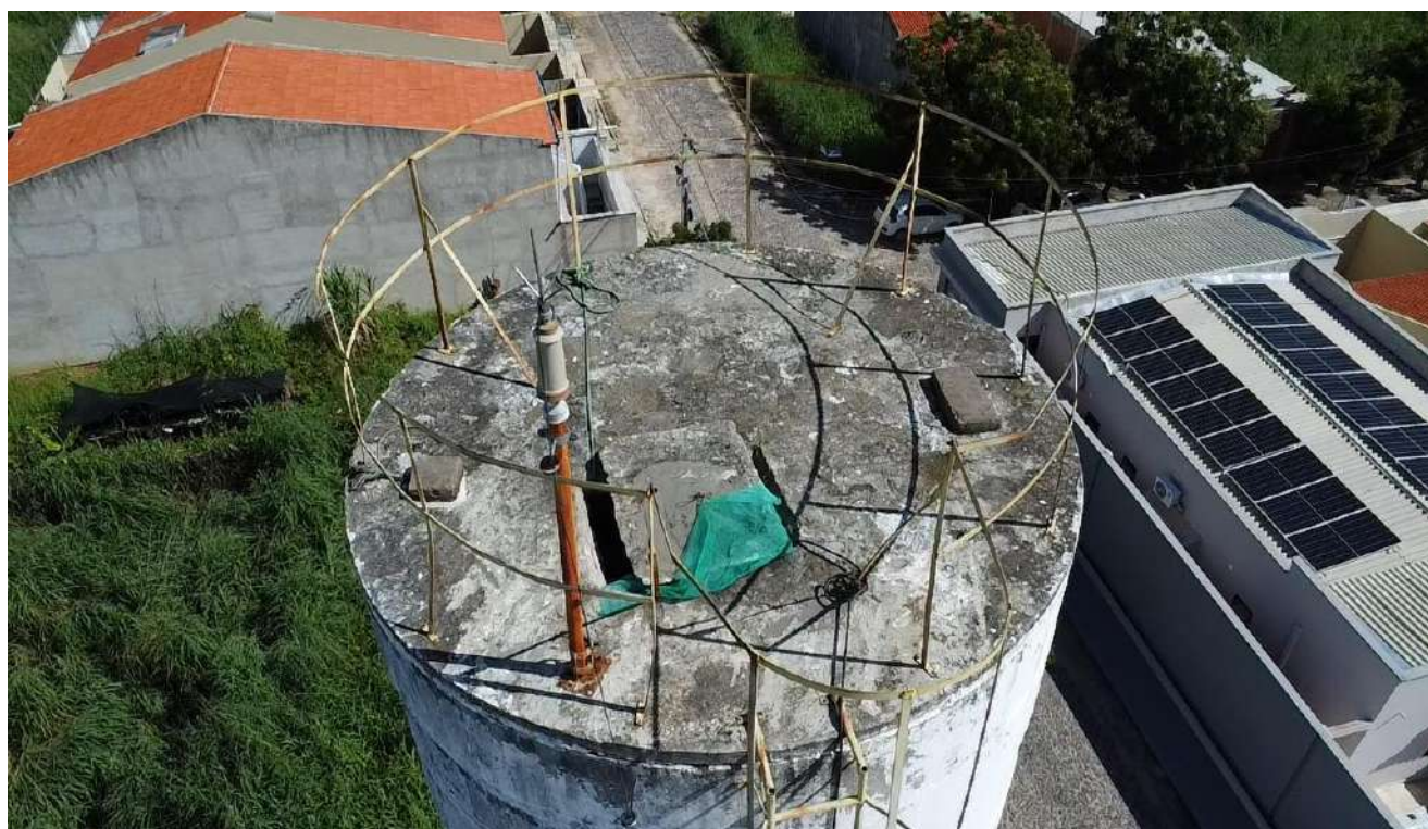
Foto 56 - REL-05: Tampa de inspeção sem fechamento hermético.
