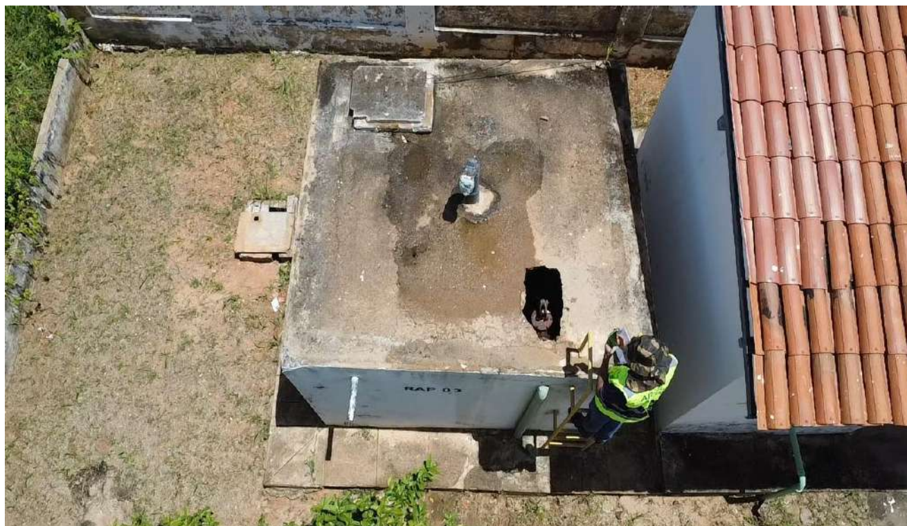
Foto 35 - RAP-03: Laje superior com falha na estrutura, comprometendo o fechamento hermético.
