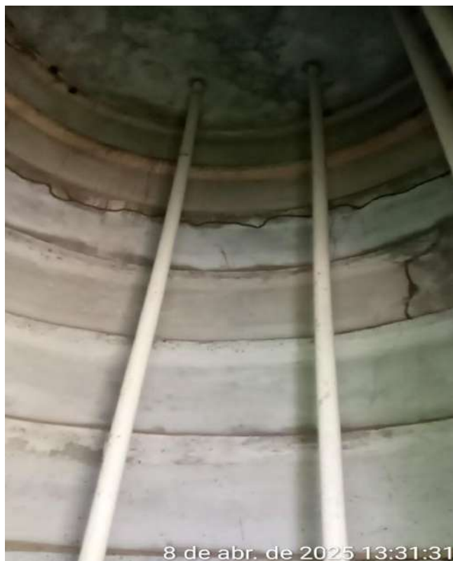
Foto 38 - REL-04: Área interna do fuste apresenta sujeira acumulada no piso e cupins nas paredes.
