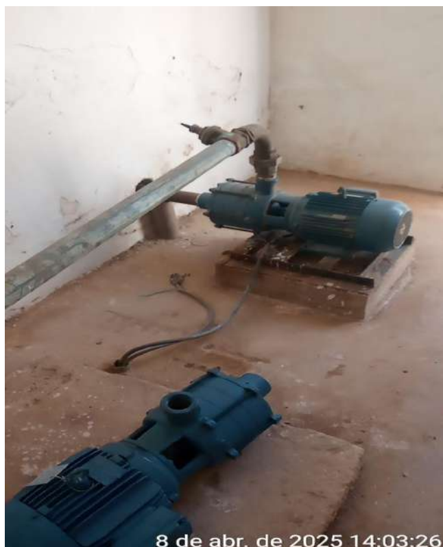
Foto 48 - EERD-01 - Fiação elétrica com pontas soltas sobre o piso da casa de bombas.
