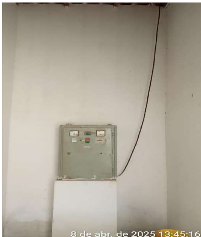
Foto 46 - EEAT-03: Cabo de alimentação do quadro de comando inadequado, sem eletroduto de proteção e isolamento.
