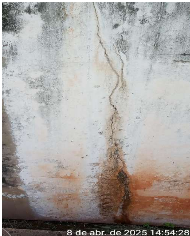
Foto 21 - RAP-02: Apresenta rachaduras.
