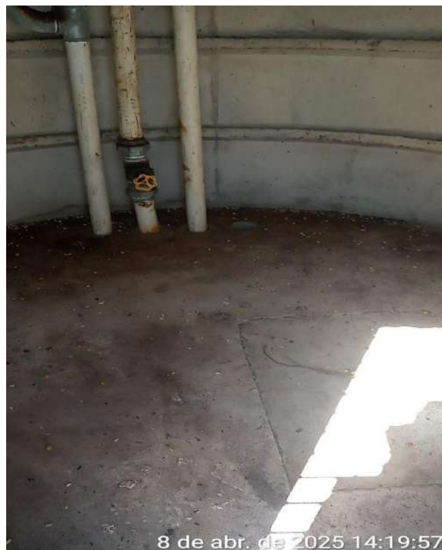
Foto 55 - REL-05: Sujeira acumulada na área do piso do fuste.
