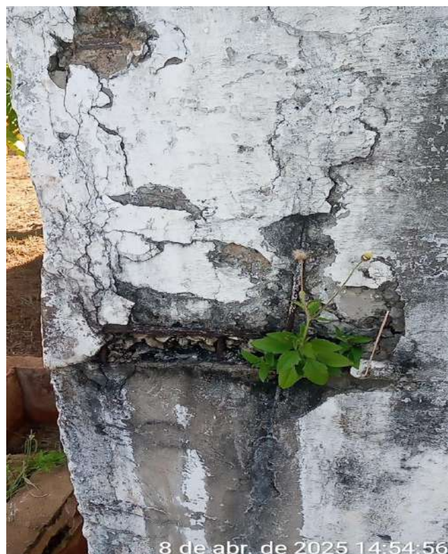
Foto 24 - RAP-02: Rachaduras e armadura exposta.
