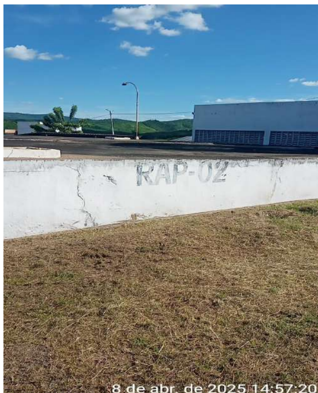
Foto 23 - RAP-02: Apresenta rachaduras; pintura deteriorada.
