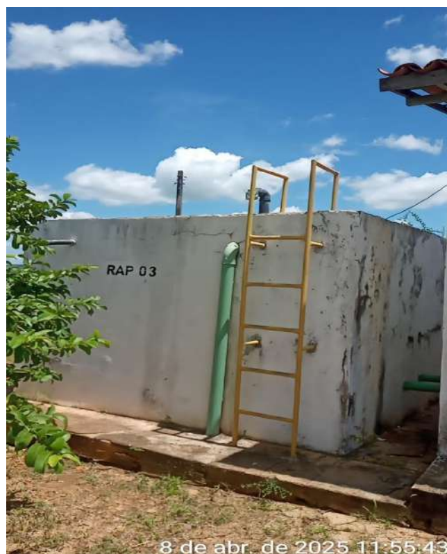
Foto 65 - RAP-03: reservatório sem grade de proteção / guarda corpo.
