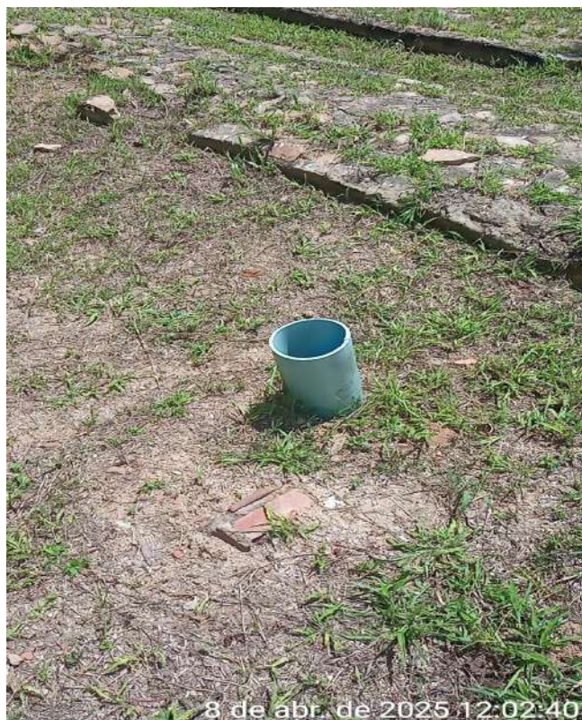
Foto 32 - RAP-03 / REL-02 / EEAT-02: Registro sem caixa de proteção.
