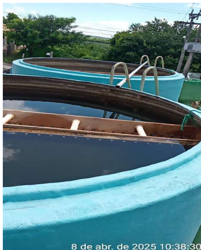
Foto 8 - ETA: Ausência de tampas.
