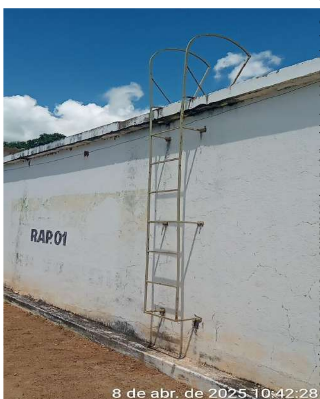
Foto 58 - RAP-01: escada tipo marinheiro inadequada, sem gaiola de proteção.
