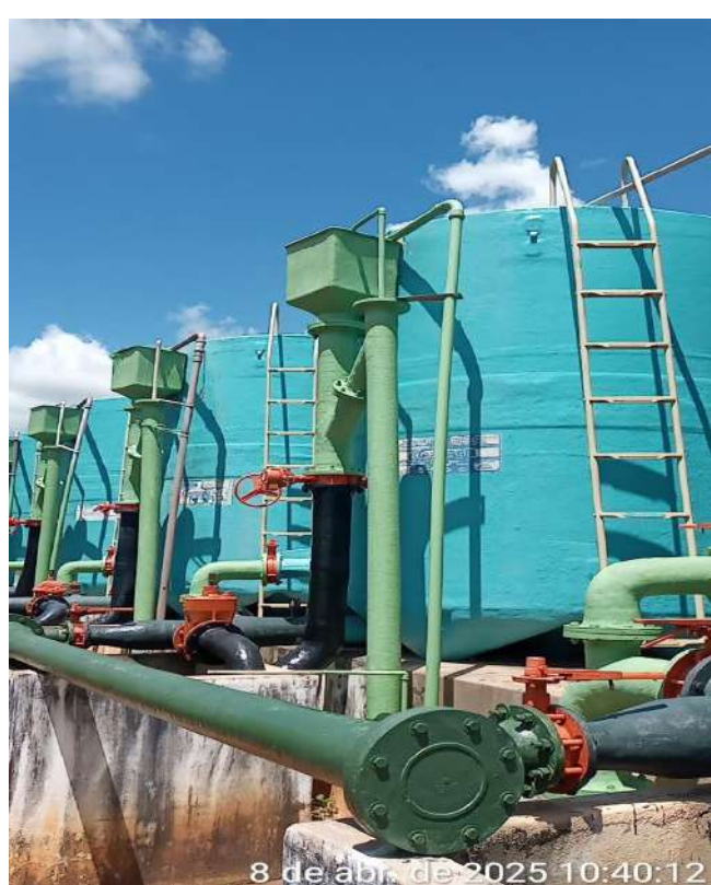
Foto 57 - Filtros: escadas tipo marinheiro inadequadas, sem gaiolas de proteção.
