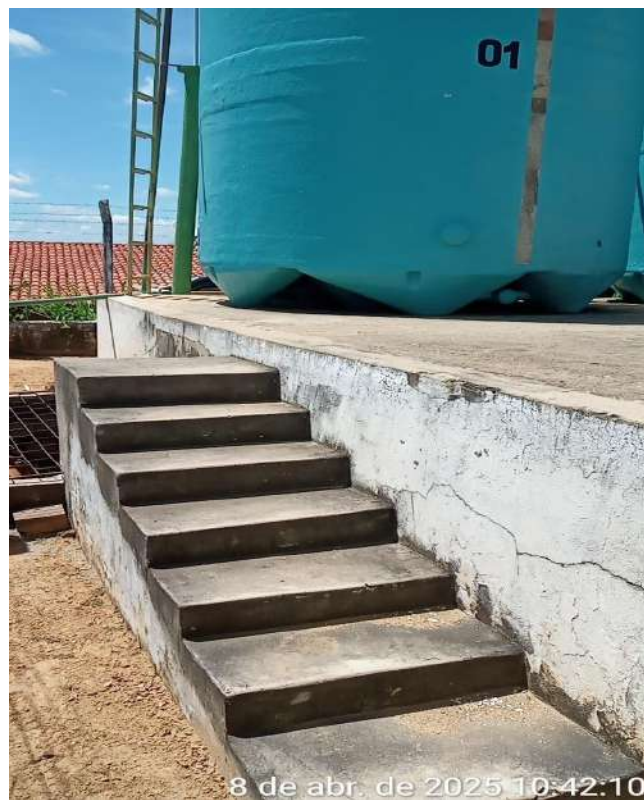
Foto 63 - ETA: Degraus de acesso a área da base de apoio dos filtros sem guarda corpo / corrimão.
