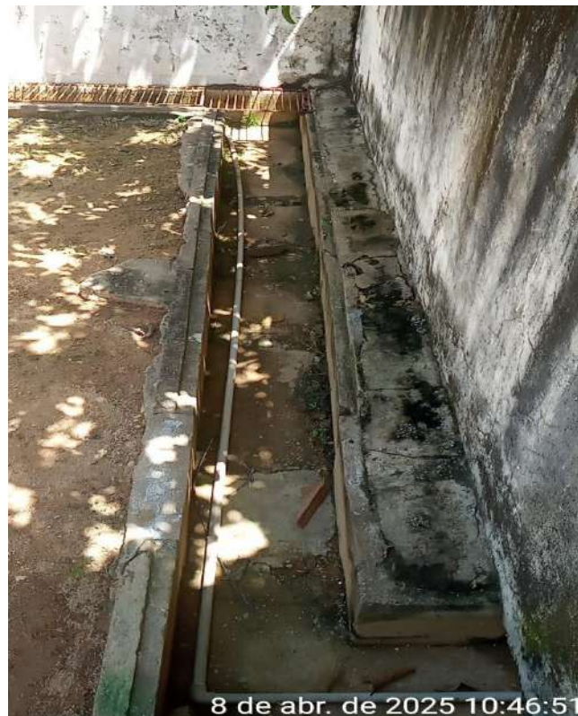
Foto 6 - ETA: Calha de drenagem com grade de proteção danificada e/ou sem grade.
