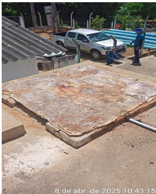
Foto 11 - ETA/RAP-01: Abertura de inspeção com tampa deteriorada.
