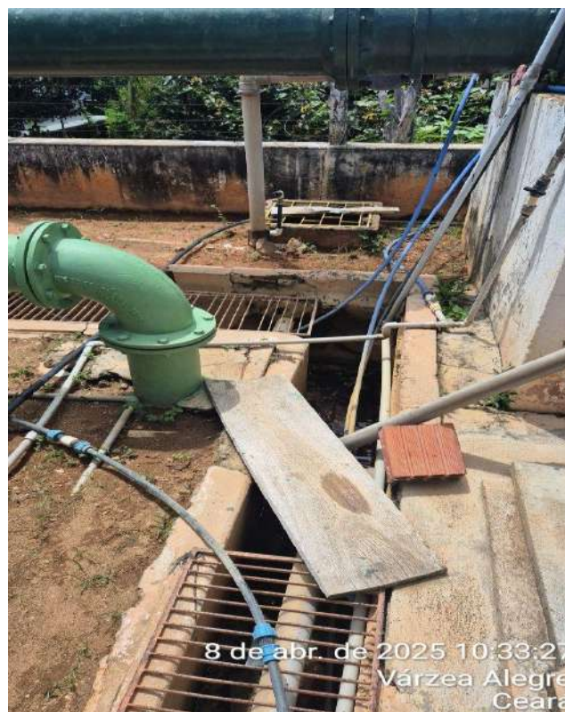
Foto 4 - ETA: Calha de drenagem com grade de proteção danificada e/ou sem grade.
