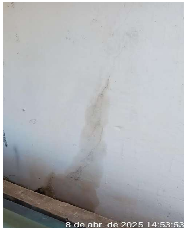
Foto 22 - RAP-02: Presença de pequeno vazamento.
