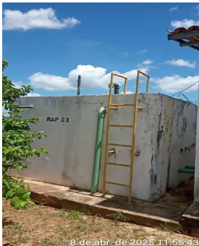
Foto 59 - RAP-03: escada tipo marinheiro inadequada, sem gaiola de proteção.
