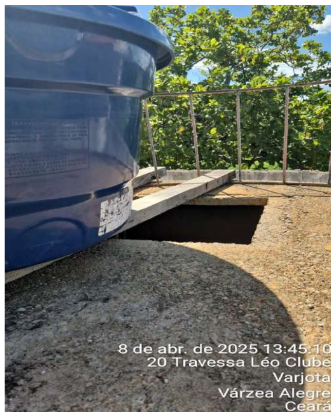
Foto 45 - RAP-04: Ausência de tampa.
