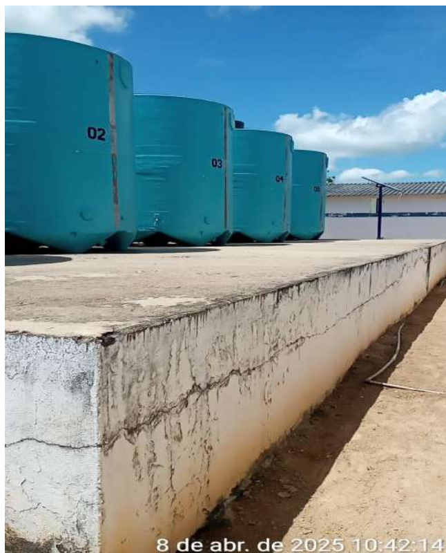
Foto 62 - ETA: Área base de apoio dos filtros sem grade de apoio e proteção / guarda corpo.
