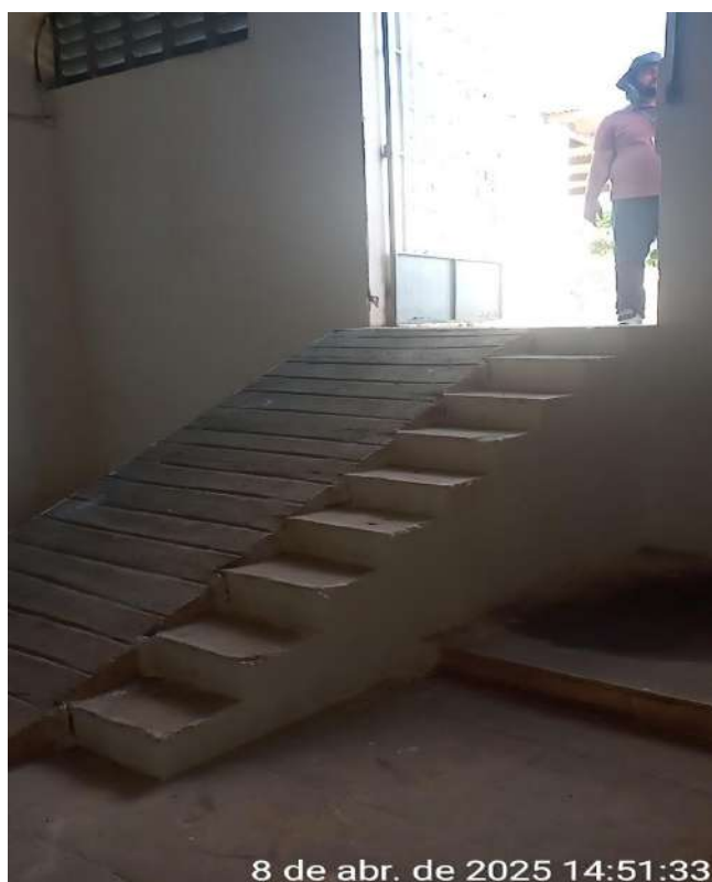
Foto 66 - EEAT-01: Degraus/rampa de acesso sem guarda-corpo (corrimão).
