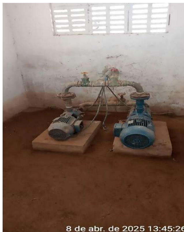
Foto 41 - EEAT-03: Piso da área interna com sujeira/lama acumulada.
