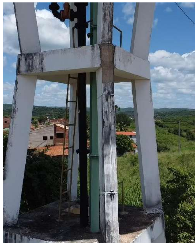
Foto 60 - REL-02: Escada sem gaiola de proteção e faltam grades de proteção (guarda-corpo) nas lajes intermediárias.
