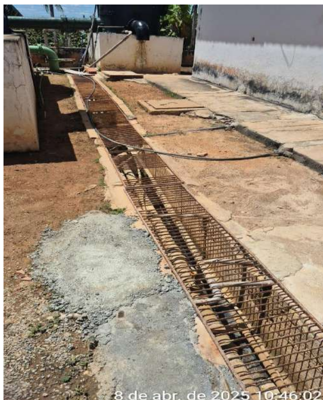
Foto 3 - ETA: Tubulação hidráulica exposta sobre o solo da área de trânsito de funcionários.
