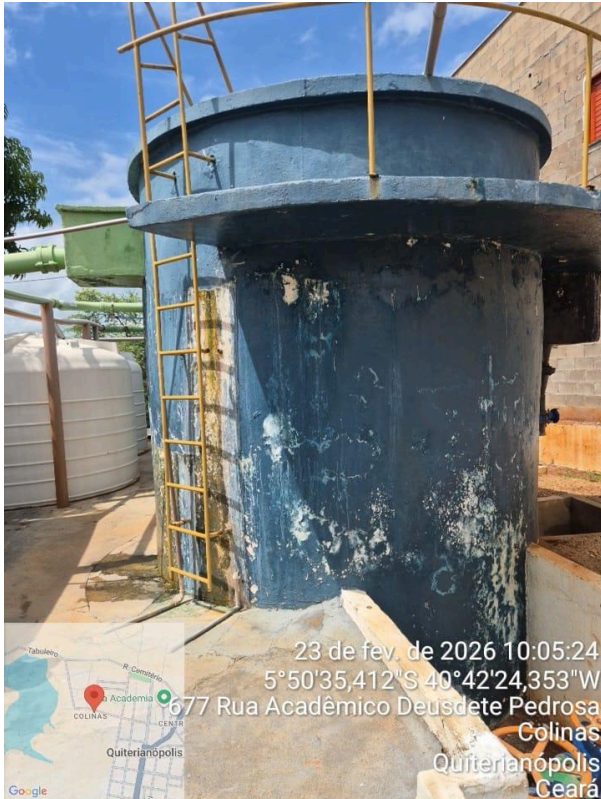
Foto 7 - ETA (F-01): pintura desgastada.
