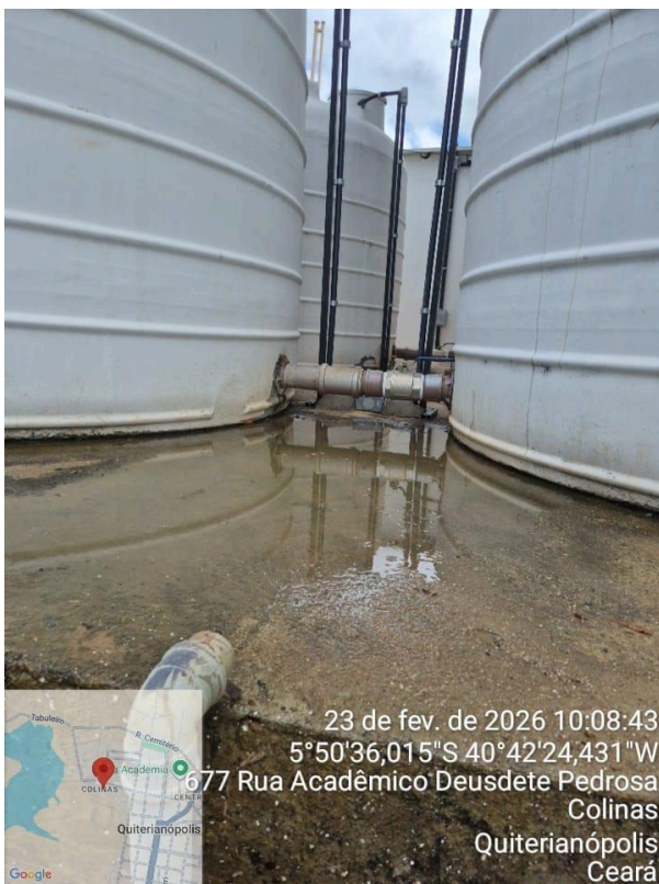
Foto 17 - RAP-06/RAP-07: presença de vazamento.
