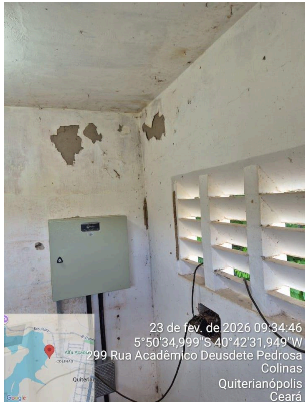
Foto 4 - Casa de comando (Captação): paredes danificadas; fiação elétrica inadequada.
