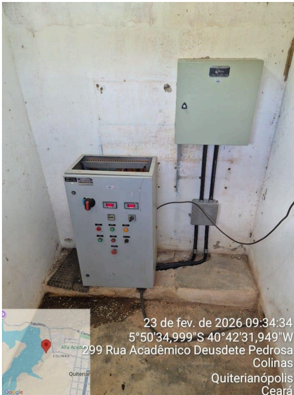
Foto 3 - Casa de comando (Captação): pintura desgastada.
