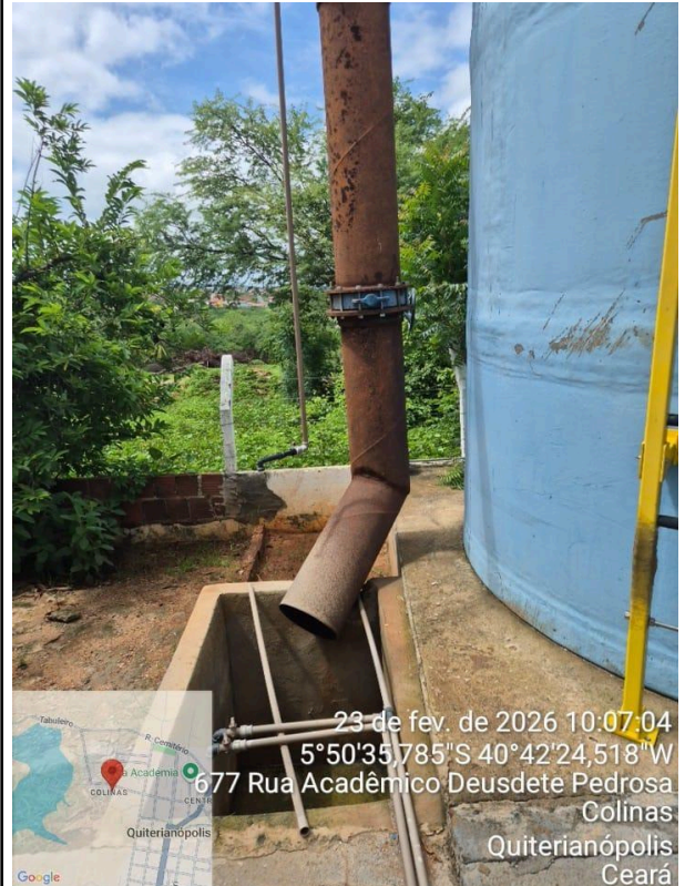
Foto 16 - ETA (F-04): tubulação de extravasamento oxidada.
