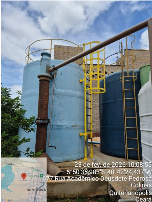
Foto 15 - ETA (F-04): tubulação de extravasamento oxidada.
