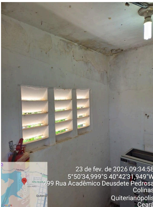
Foto 5 - Casa de comando (Captação): pintura desgastada.
