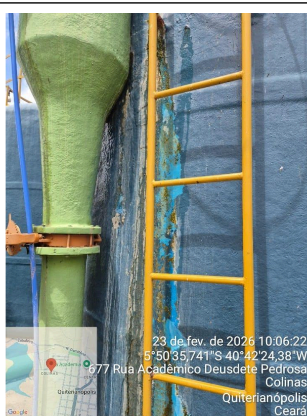
Foto 12 - ETA (F-02): presença de vazamento.
