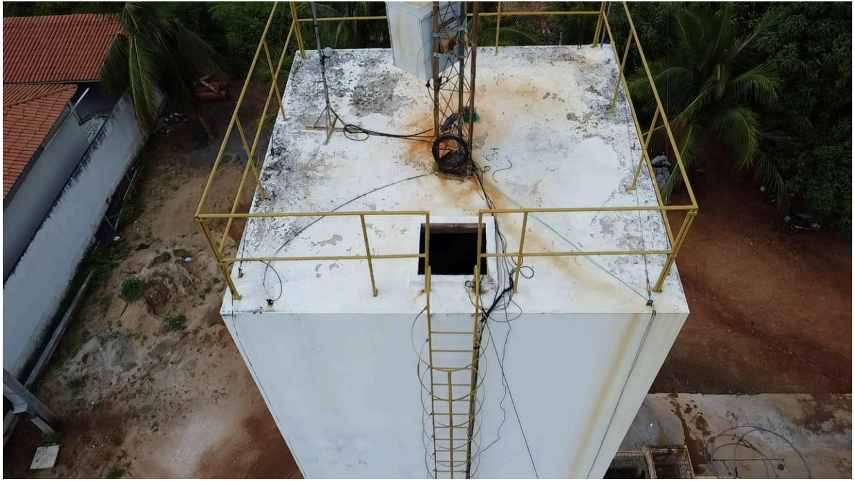
Foto 23 - ETA (REL-01): ausência de tampa de inspeção; fiação inadequada.
