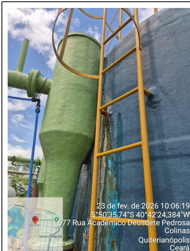
Foto 11 - ETA (F-02): presença de rachaduras e de vazamento.
