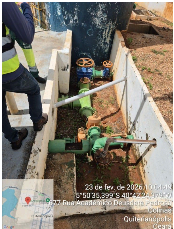
Foto 6 - ETA (filtros): ausência de grade de proteção na área dos registros.
