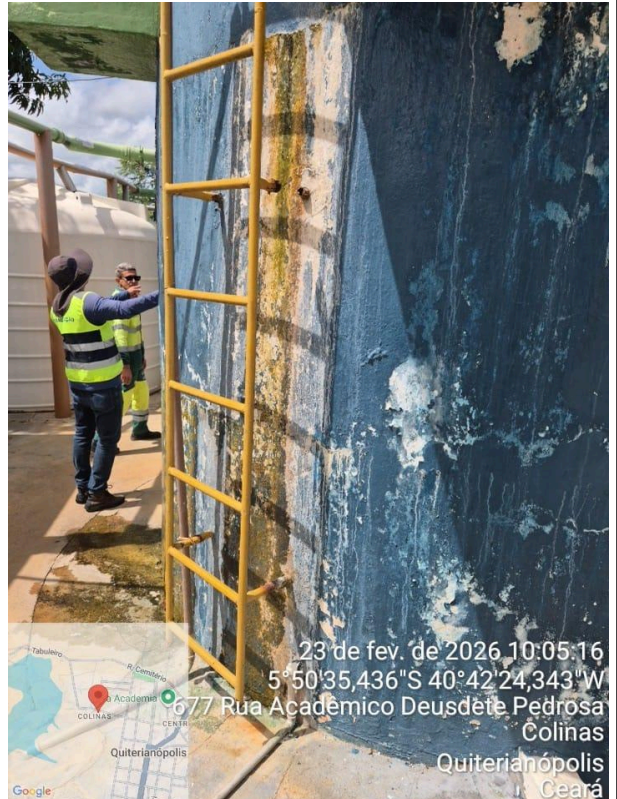
Foto 8 - ETA (F-01): pintura desgastada; escada danificada.
