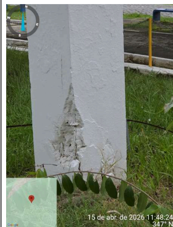
Foto 19 - REL-01 desativado (Sede): armadura exposta na base, com colunas de sustentação desgastadas.
