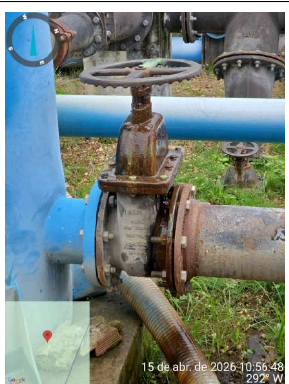
Foto 10 - ETA Pacatuba: vazamento na válvula da torre de nível.
