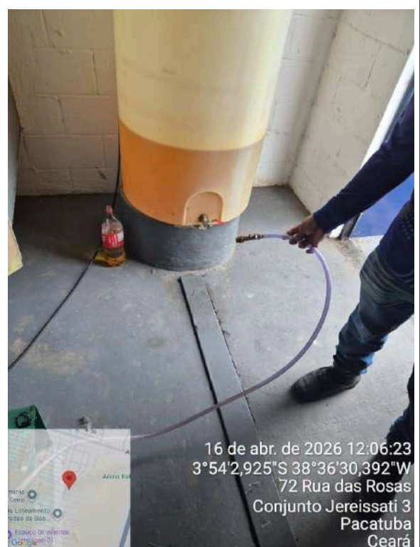
Foto 63 - EEE-02 (Jereissati): gerador sem engate para combustível.
