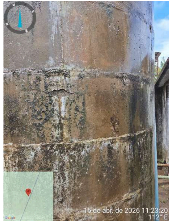
Foto 26 - RAP-01 (Sede): RAP com indícios de infiltração.
