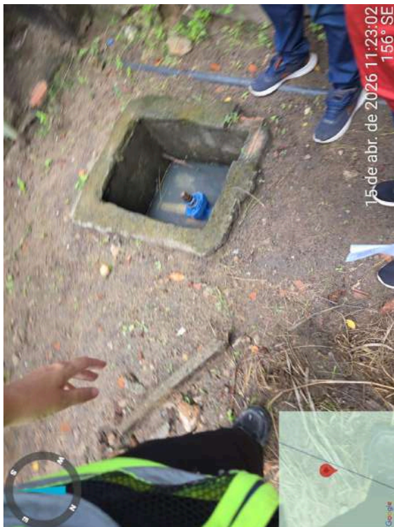
Foto 27 - RAP-01 (Sede): caixa de registro sem tampa, com riscos de queda.
