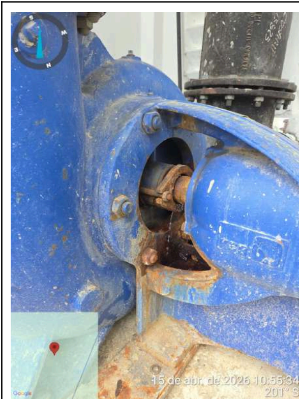
Foto 5 - ETA Pacatuba: bomba de lavagem da ETA com vazamento.
