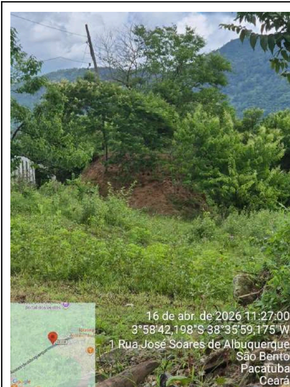
Foto 49 - ETE Pacatuba: possível formigueiro na ETE.
