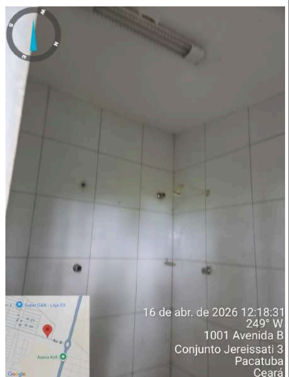
Foto 67 - ETE Mãe Rainha (Jereissati): banheiro com sujeiras e sem iluminação.
