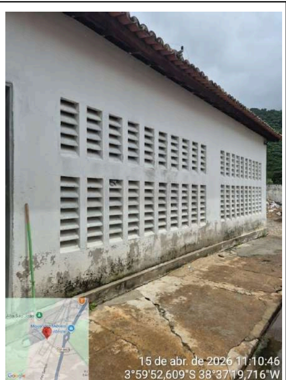
Foto 14 - ETA Pacatuba: sala operador com pintura desgastada, porta quebrada e passeio com rachaduras.
