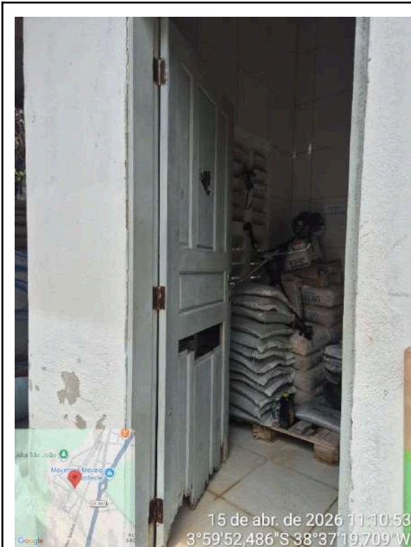
Foto 13 - ETA Pacatuba: sala operador com pintura desgastada e porta quebrada.
