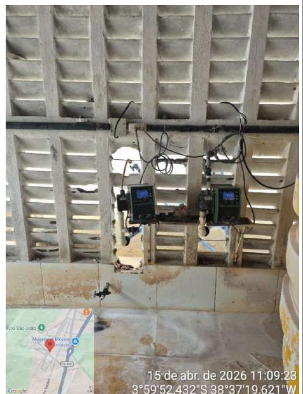
Foto 12 - ETA Pacatuba: sala de química com cobogós com armadura exposta e fiação sem eletrodutos.
