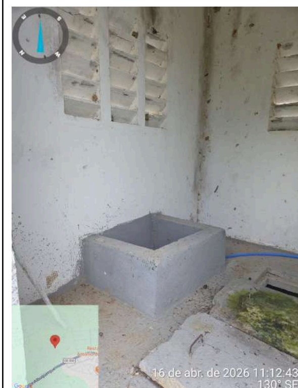
Foto 47 - ETE Pacatuba: casa de química com problemas de infraestrutura.
