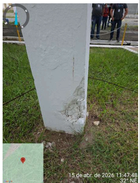
Foto 20 - REL-01 desativado (Sede): armadura exposta na base, com colunas de sustentação desgastadas.
