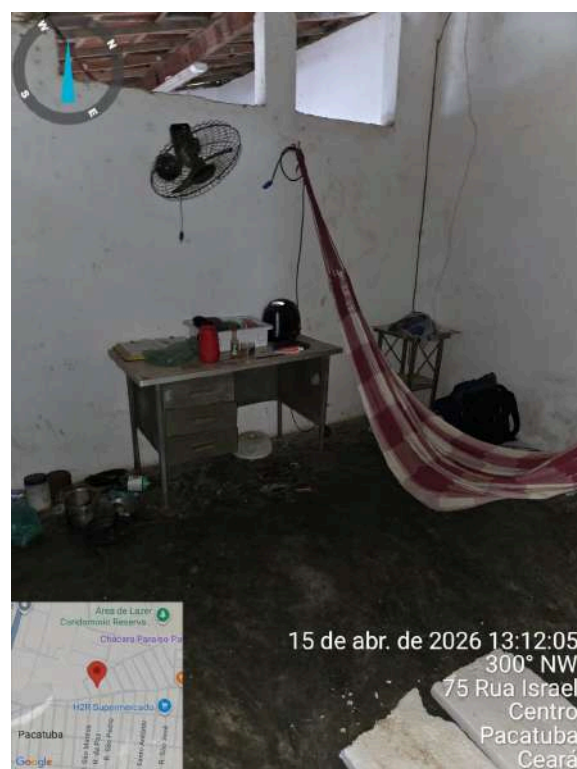
Foto 31 - Núcleo Pavuna: alojamento improvisado para operadores com goteira e sem local adequado para descanso.
