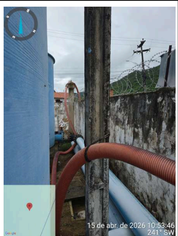
Foto 4 - ETA Pacatuba: parede da ETA com pintura desgastada.
