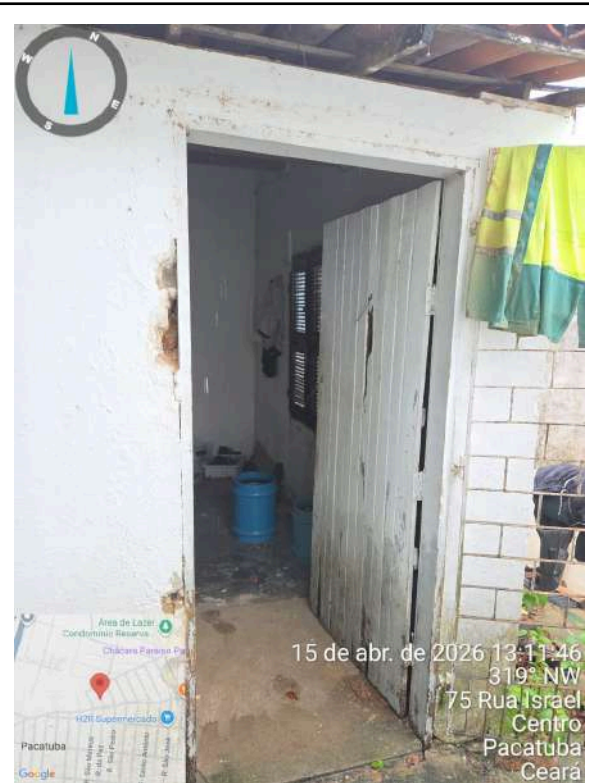
Foto 33 - Núcleo Pavuna: alojamento improvisado com porta defeituosa.
