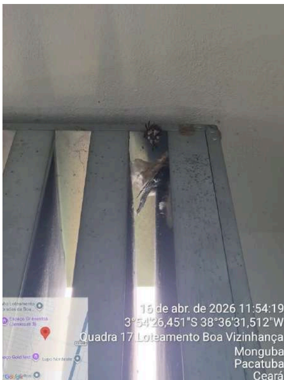
Foto 58 - EEE-01 (Jereissati): casa do gerador com casa de marimboneiro.
