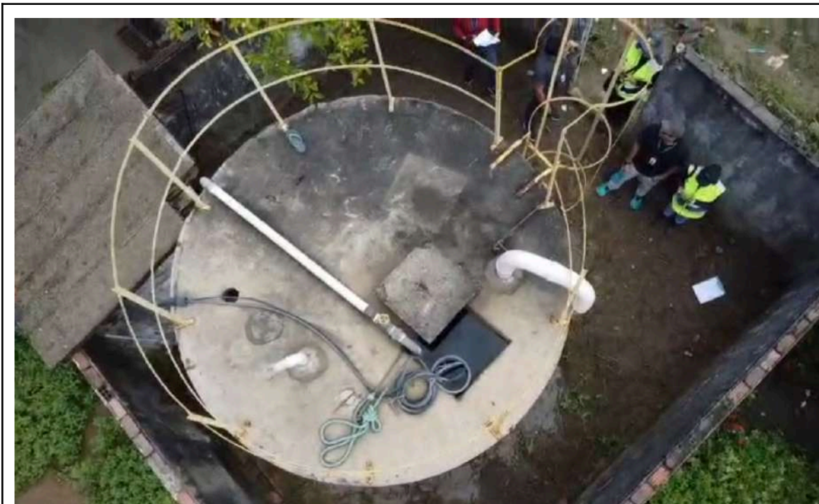
Foto 29 - RAP-01 (Sede): tampa deslocada, com fiação próxima a entrada do RAP e tubulação entrando pela abertura inadequada.
