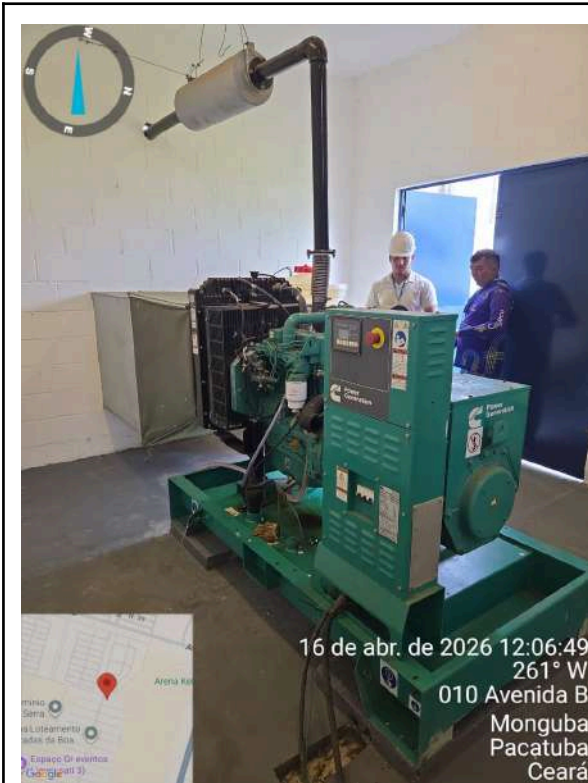
Foto 64 - EEE-02 (Jereissati): gerador parado, em manutenção.
