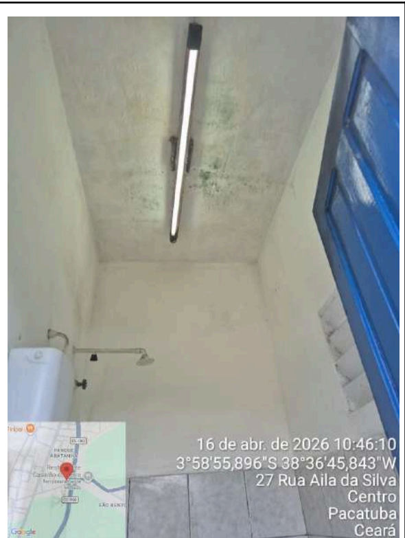
Foto 43 - EEE-02 (Sede): banheiro com mofo no teto.
