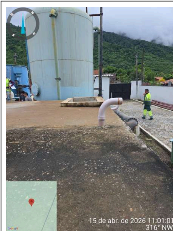
Foto 17 - ETA Pacatuba / RSE-01: suspiros sem proteção.
