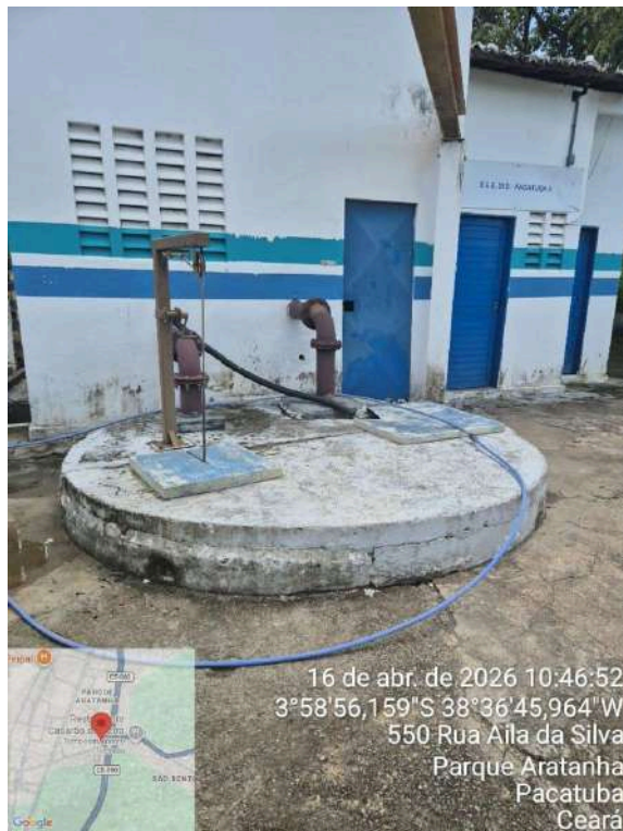
Foto 40 - EEE-02 (Sede): poço com tampa parcialmente quebrada e desgastada.
