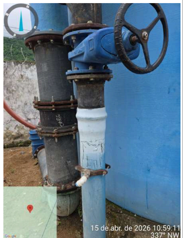
Foto 8 - ETA Pacatuba: vazamento no registro de todos os filtros.
