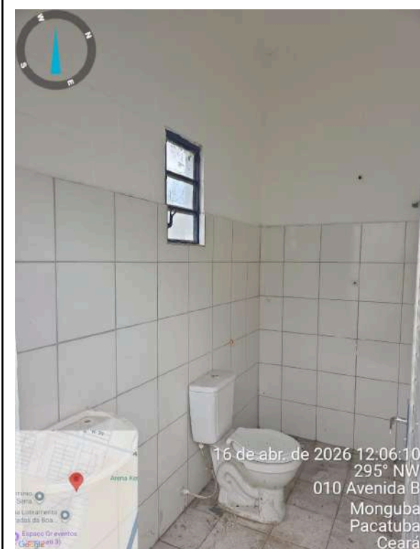
Foto 62 - EEE-02 (Jereissati): banheiro com sujidades.
