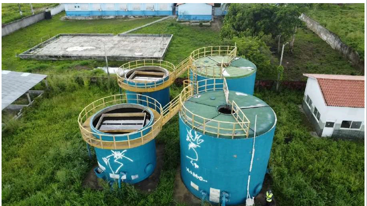
Foto 73 - ETE Mãe Rainha (Jereissati): reatores UASB com pichações.
