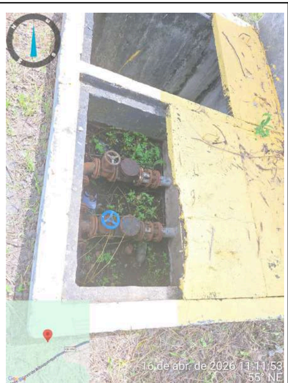
Foto 46 - ETE Pacatuba: tubulação oxidada.
