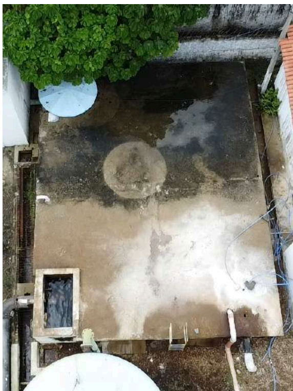
Foto 15 - ETA Pacatuba / RSE-01: laje desgastada, com manchas de lodo, resíduo de cloro e tampa improvisada em uma abertura.
