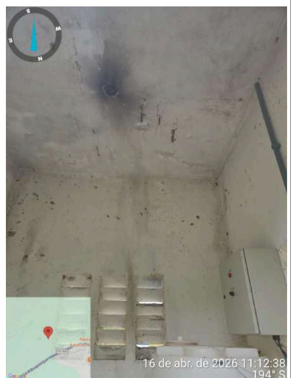
Foto 48 - ETE Pacatuba: casa de química sem iluminação e com armadura exposta.
