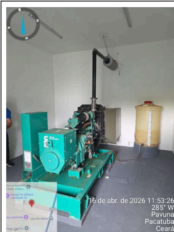
Foto 56 - EEE-01 (Jereissati): gerador parado, em manutenção.
