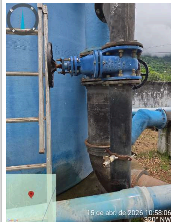
Foto 7 - ETA Pacatuba: vazamento na válvula de descarga e no registro de todos os filtros.
