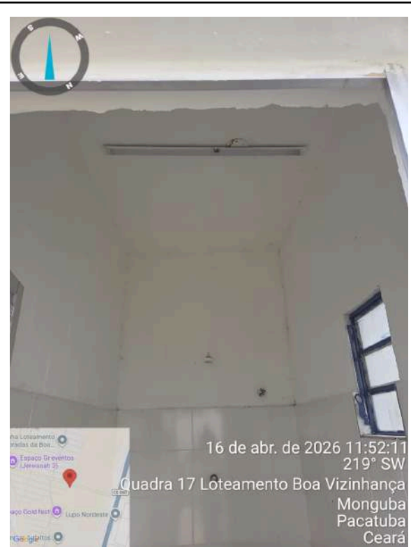
Foto 53 - EEE-01 (Jereissati): banheiro sem lâmpada.
