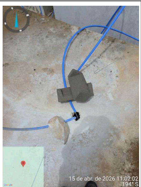
Foto 18 - ETA Pacatuba / RSE-01: cloração com apoio inadequado, por meio de abertura na laje superior do reservatório.
