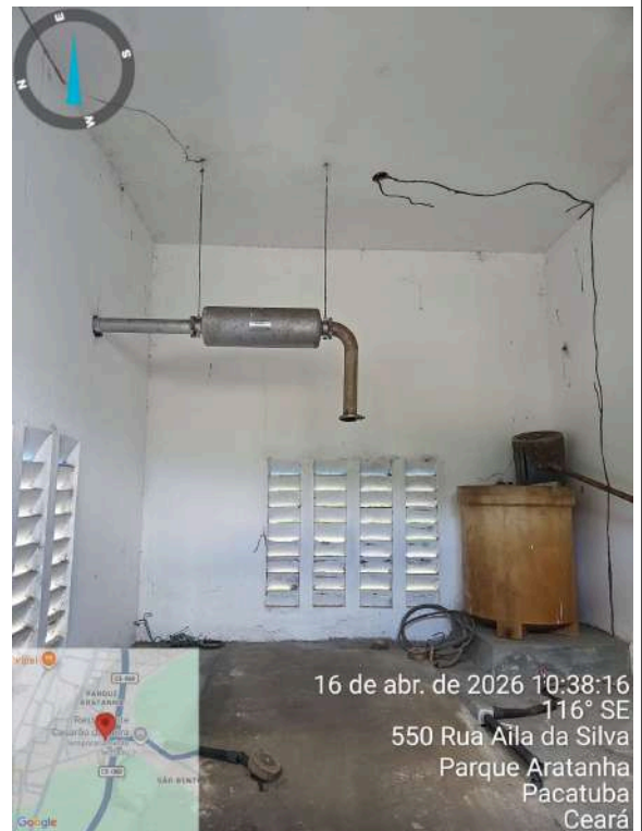
Foto 41 - EEE-02 (Sede): casa do gerador com presença de cupim.
