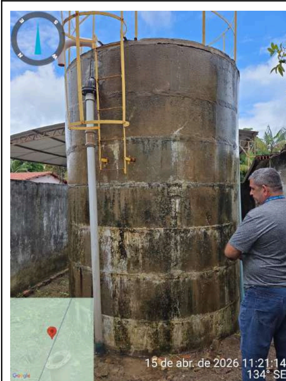
Foto 25 - RAP-01 (Sede): RAP com indícios de infiltração.
