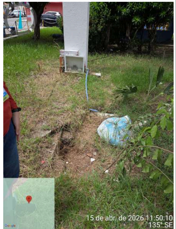
Foto 22 - REL-01 desativado (Sede): abertura no chão com erosão, apresentando risco de acidente.
