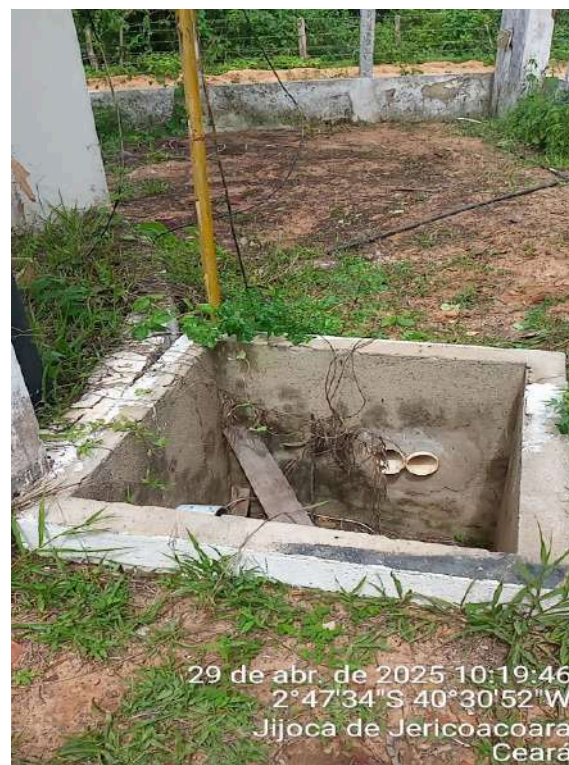
Foto 6 - REL-01: caixa de inspeção sem tampa.
