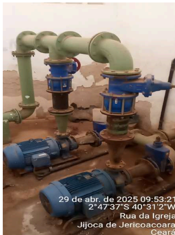
Foto 32 - EEAT-01: infraestrutura deteriorada, rachadura na parede, reboco e pintura desgastados.
