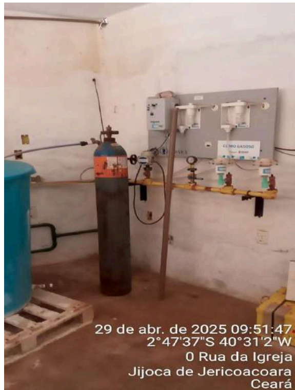
Foto 72 - Cloro Gasoso: instalações desativadas.
