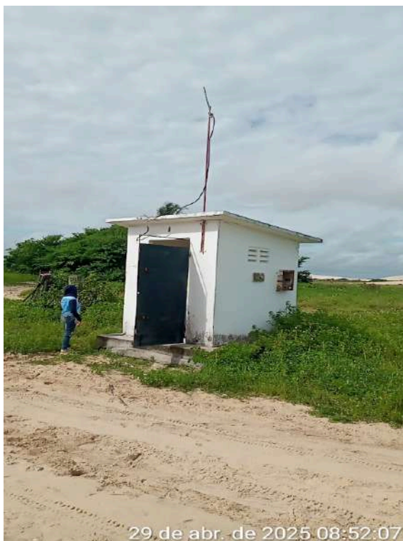
Foto 3 - PT-05 e PT-06: poços e casa do quadro de comando sem identificação.
