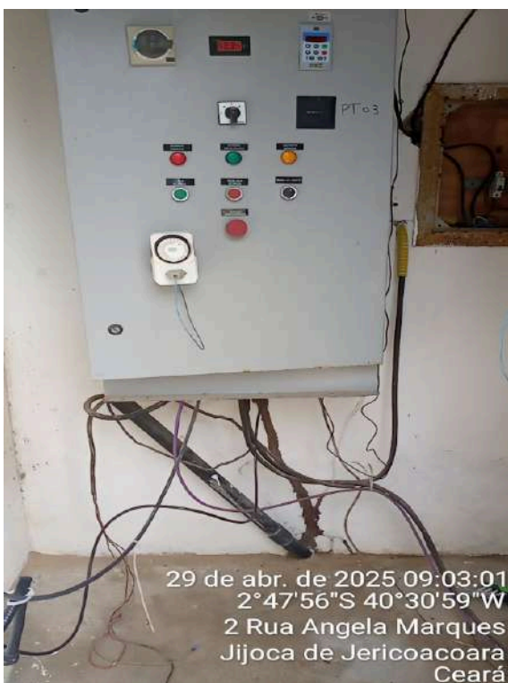
Foto 41 - PT-03 e PT-04: instalações elétricas do quadro de comando precárias, sem eletroduto de proteção e isolamento.
