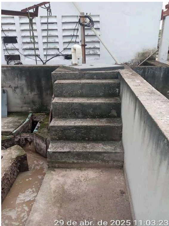
Foto 9 - Tratamento Preliminar (ETE) : ausência de guarda corpo na escada de acesso ao fosso.
