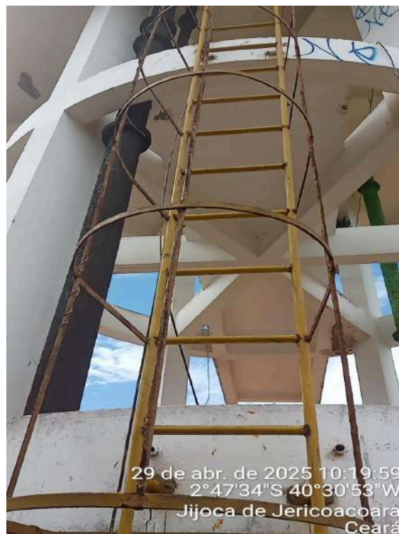
Foto 48 - REL-01: escada em processo de corrosão.
