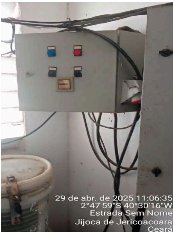
Foto 13 - EEE-02: instalações elétricas precárias com fios/cabos sem eletrodutos de proteção e isolamento na casa de bombas e casa do quadro de comandos.
