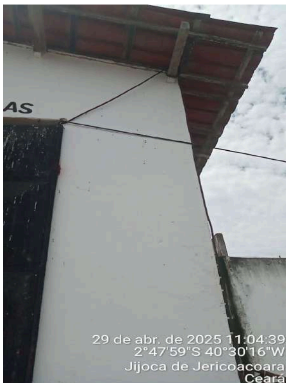
Foto 11 - EEE-02: sem identificação; instalações elétricas precárias com fios/cabos sem eletrodutos de proteção e isolamento na casa de bombas.
