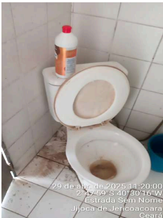
Foto 66 - Banheiro: instalações sanitárias e elétricas precárias sem higiene adequada.
