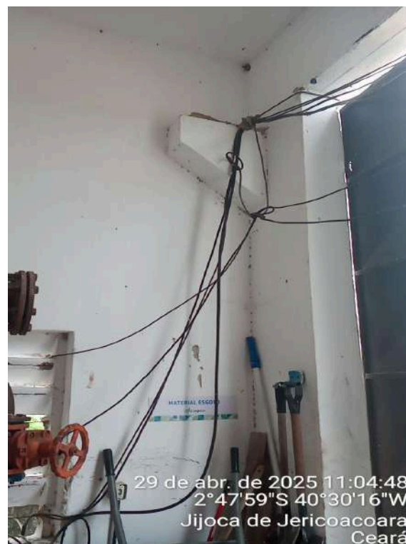
Foto 12 - EEE-02: instalações elétricas precárias com fios/cabos sem eletrodutos de proteção e isolamento na casa de bombas e casa do quadro de comandos.
