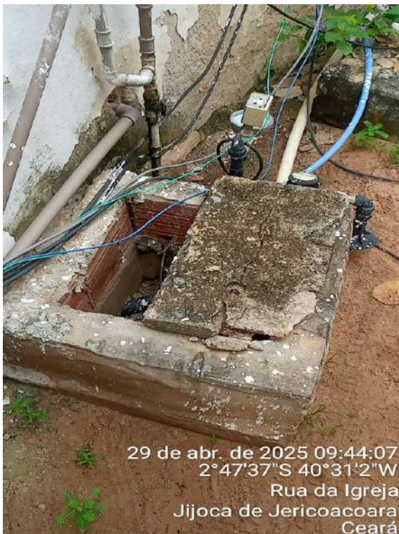
Foto 24 - EEAT-01 e RAP-01: macromedidores com caixa danificada ou sem tampa de proteção.
