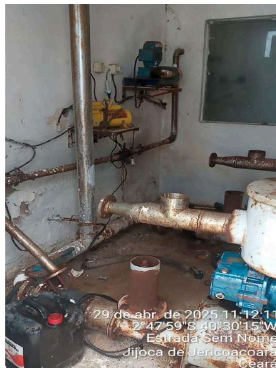
Foto 59 - Casa de sopradores: em manutenção, com tubulações dos sopradores em processo de corrosão.
