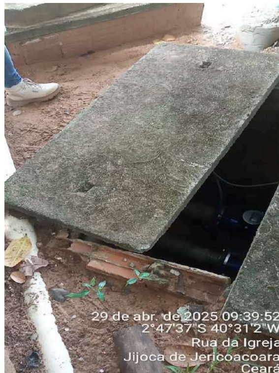
Foto 25 - EEAT-01 e RAP-01: macromedidores com caixa danificada ou sem tampa de proteção;
