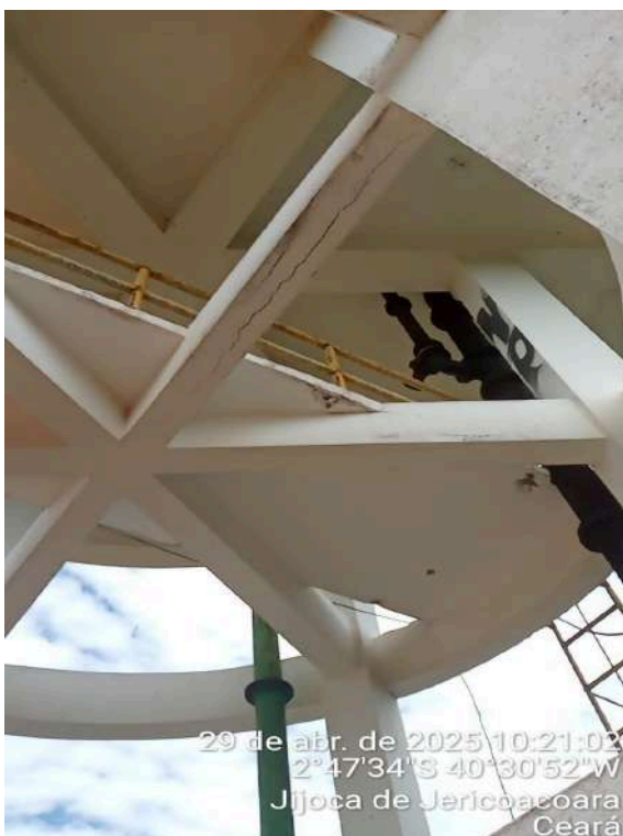
Foto 49 - REL-01: viga com rachadura; tubulações de subida e descida em processo de corrosão.
