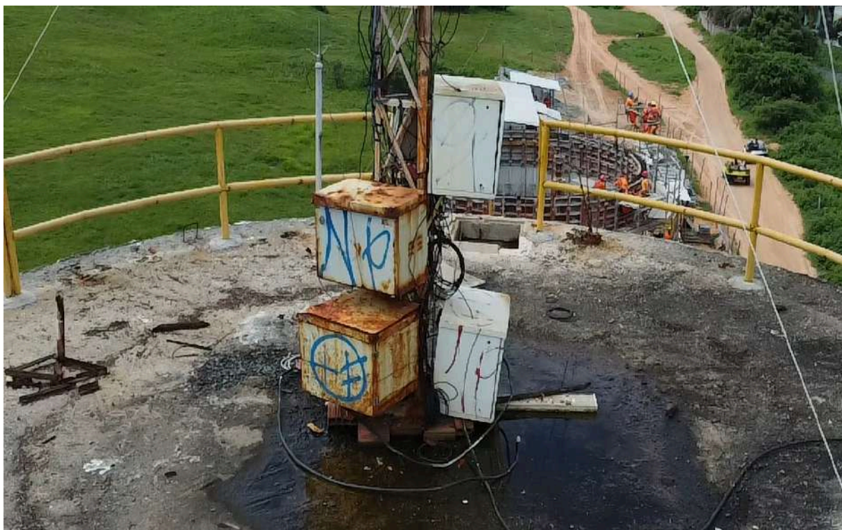
Foto 51 - REL-01: restos de materiais e fios/cabos elétricos sobre a laje do reservatório.
