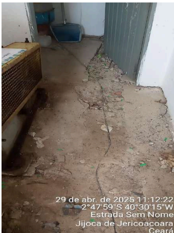
Foto 60 - Casa de sopradores: em manutenção, com piso e paredes danificados.
