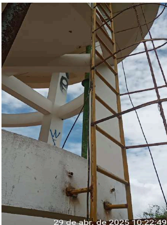
Foto 5 - REL-01: instalações elétricas inadequadas com fios/cabos instalados junto a escada sem eletroduto de proteção e isolamento.
