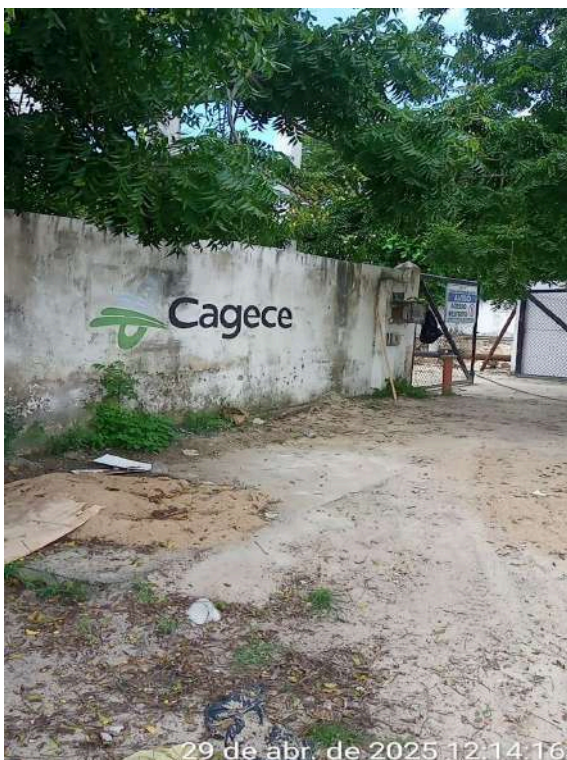
Foto 75 - EEE-01: em reformas, com pintura deteriorada
