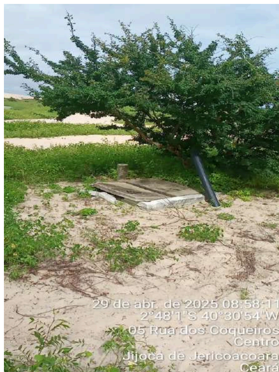
Foto 38 - PT-05 e PT-06: caixa de proteção do PT-05 danificada.
