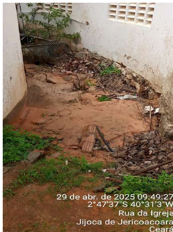
Foto 23 - EEAT-01 e RAP-01: apresentando área de circulação com solo erodido.
