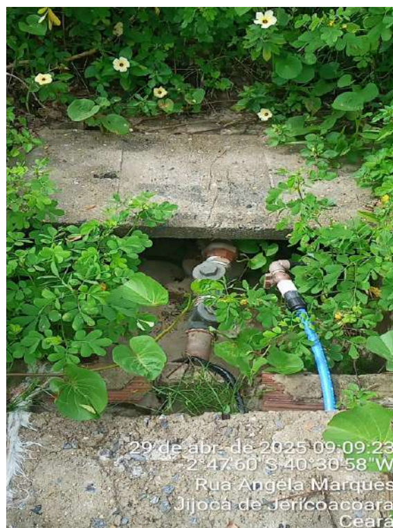
Foto 42 - PT-03 e PT-04: caixa de proteção do PT-03 assoreada e com tampa danificada.
