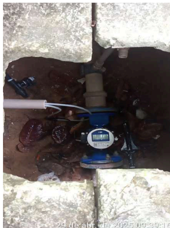
Foto 27 - EEAT-01 e RAP-01: macromedidores com caixa danificada ou sem tampa de proteção.
