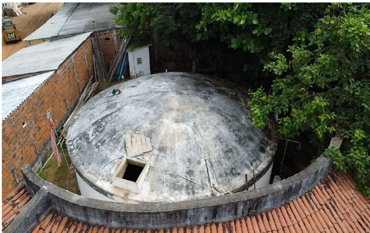
Foto 30 - RAP-01: com escada tipo marinheiro sem fixação, improvisada e inadequada; tampa de abertura de inspeção sem tampa ou tampa danificada; furos de entrada de tubulação; entre outros, sem acabamento; fios/cabos instalados por sobre a laje de cobertura.
