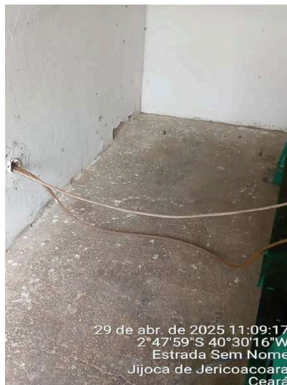
Foto 16 - Grupo Gerador: mangueiras do tanque de óleo desprotegidas, sobre o piso na área de circulação, sem calha de proteção e isolamento.
