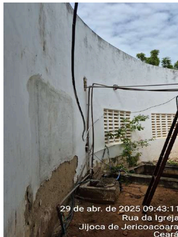
Foto 29 - EEAT-01 e RAP-01: RAP com escada tipo marinheiro sem fixação, improvisada e inadequada; caixa de registro de descarga sem tampa.
