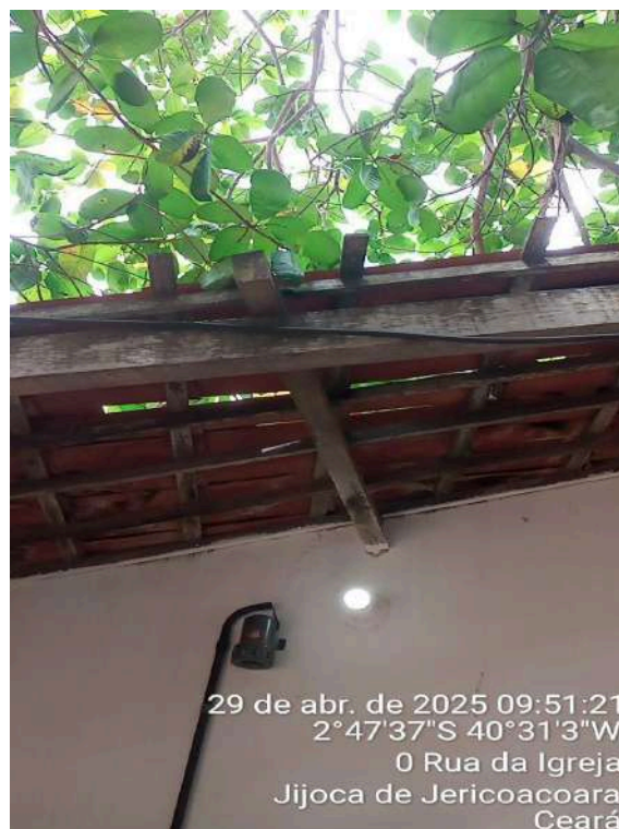
Foto 34 - EEAT-01: infraestrutura deteriorada, telhado danificado.
