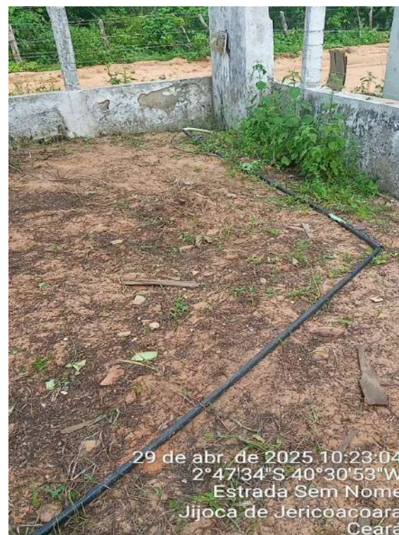
Foto 50 - REL-01: eletroduto exposto sobre o solo na área de circulação.
