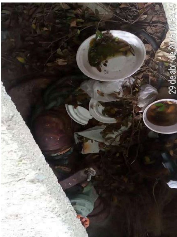
Foto 39 PT-05 e PT-06: caixa de proteção do PT-06 assoreada e acúmulo de lixo.
