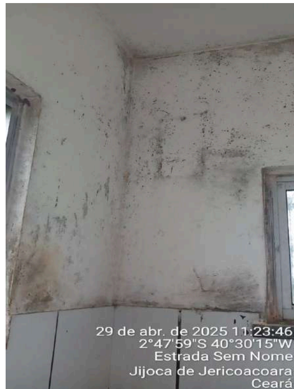
Foto 70 - Laboratório: pintura deteriorada.
