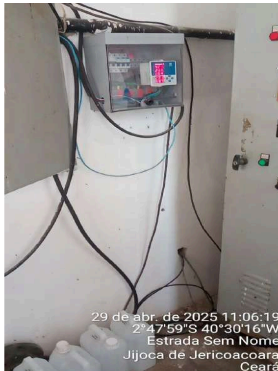
Foto 14 - EEE-02: instalações elétricas precárias com fios/cabos sem eletrodutos de proteção e isolamento na casa de bombas e casa do quadro de comandos.
