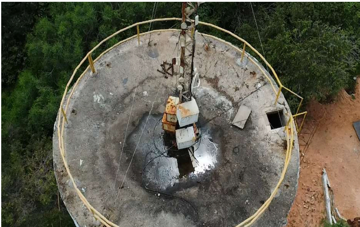
Foto 7 - REL-01: abertura de inspeção da laje superior sem tampa de proteção.
