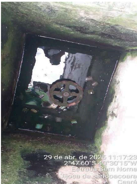
Foto 56 - ETE Antiga: caixa sem tampa de inspeção ou tampas fora do lugar; caixa assoreada com lodos e outros materiais.
