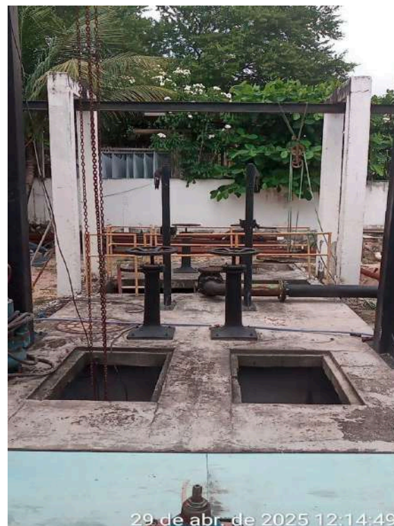
Foto 76 - EEE-01: em reformas, com poços de sucção sem tampas ou tampas fora do lugar
