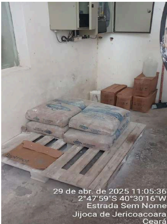
Foto 73 - EEE-02: materiais armazenados indevidamente na área de circulação da casa de bombas e do quadro de comandos.
