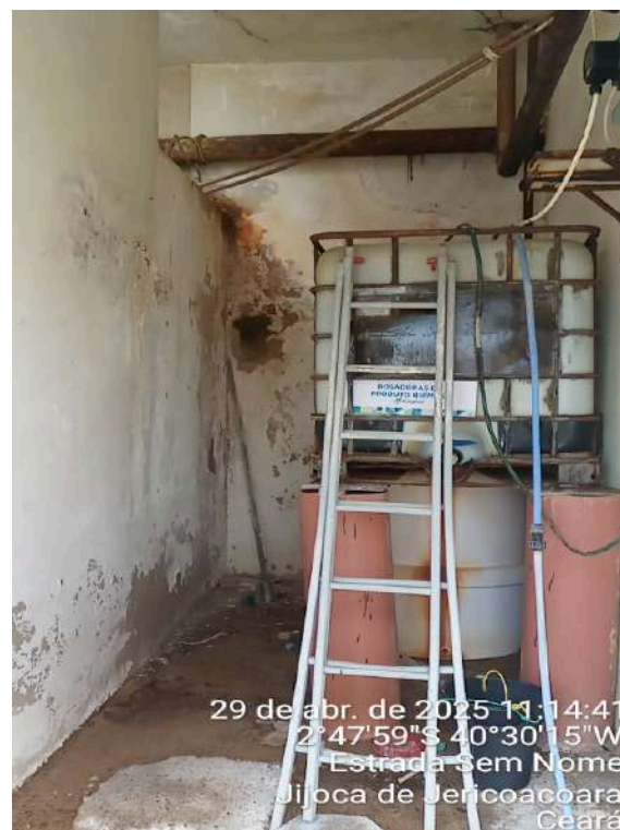
Foto 19 - Casa de Química: instalações do tanque dosador com estrutura de apoio e escada de acesso improvisadas.
