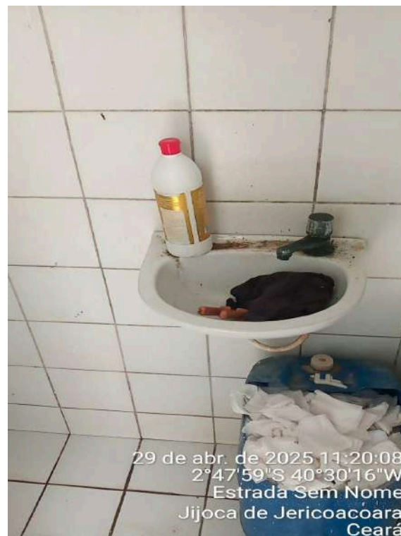
Foto 67 - Banheiro: instalações sanitárias e elétricas precárias sem higiene adequada.
