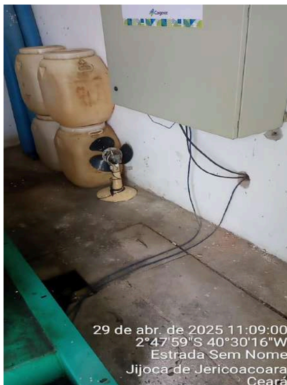
Foto 15 - Grupo Gerador: instalações precárias, com fio/cabos elétricos instalados sobre a área de circulação, sem calha de proteção e isolamento.
