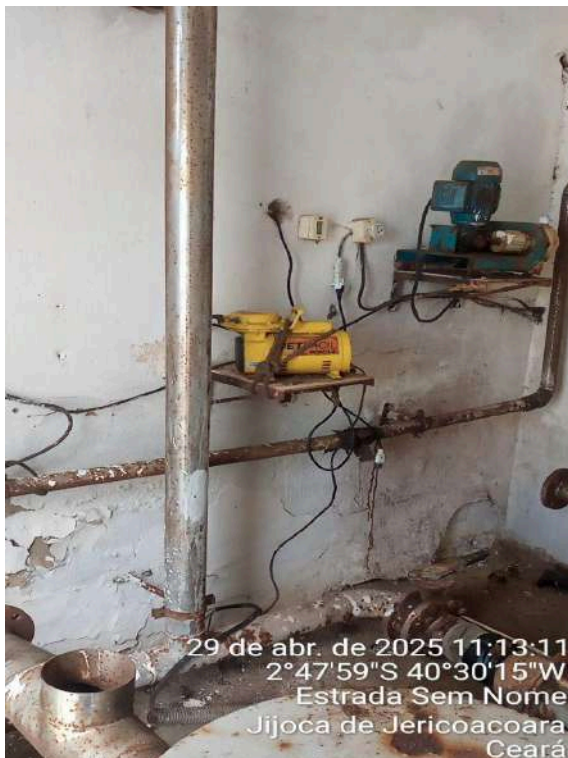
Foto 62 - Casa de sopradores: pintura deteriorada; instalações elétricas precárias, instaladas sobre o piso, sem eletroduto de proteção e isolamento; materiais armazenados indevidamente.
