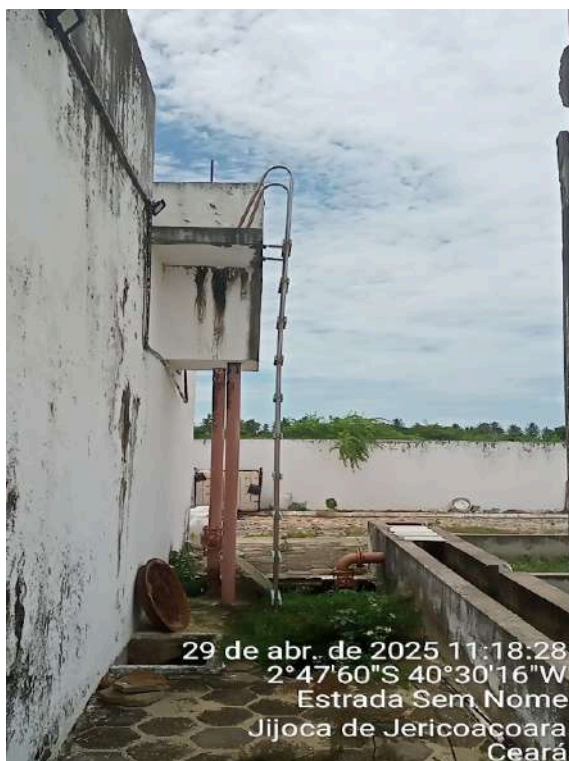
Foto 18 - Reatores: escada de acesso tipo marinheiro inadequada, sem gaiola de proteção.
