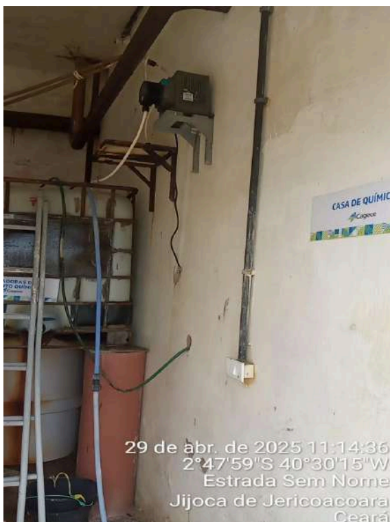
Foto 64 - Casa de Química: pintura deteriorada; tubulação dos sopradores em processo avançado de corrosão.
