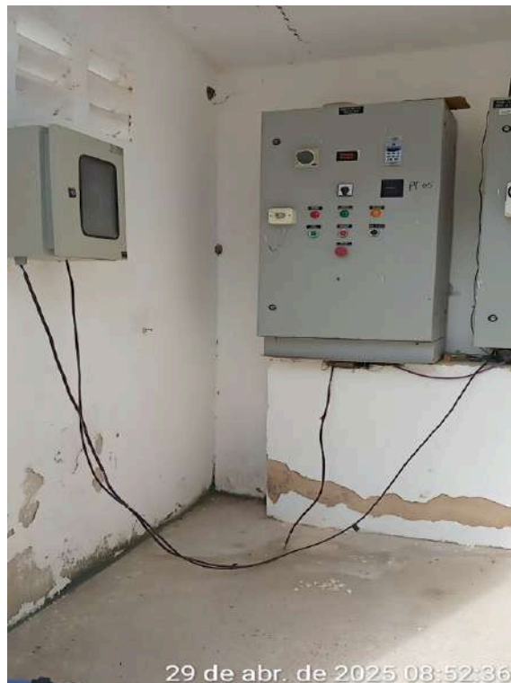
Foto 36 - PT-05 e PT-06: pintura deteriorada; instalações elétricas precárias, sem eletrodutos de proteção e isolamento.
