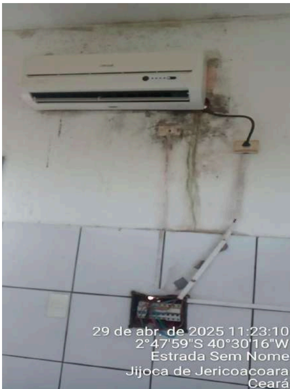
Foto 69 - Laboratório: instalações elétricas precárias; pintura deteriorada.
