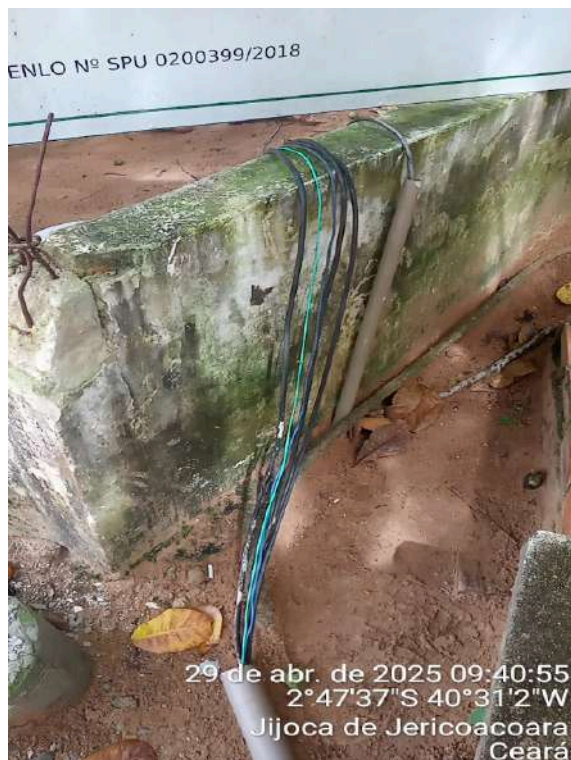
Foto 28 - EEAT-01 e RAP-01: instalações elétricas sem eletroduto de isolamento e proteção.
