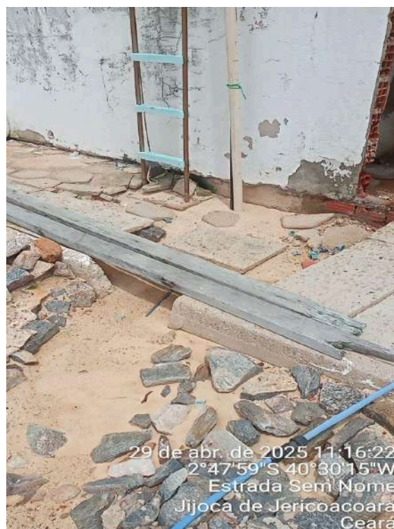
Foto 53 - ETE Antiga: pavimentação deteriorada.
