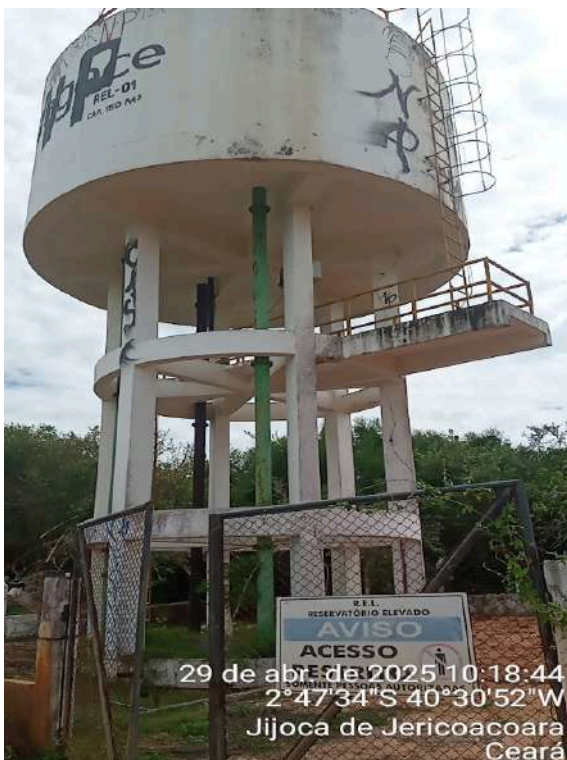
Foto 47 - REL-01: pintura deteriorada; portão com tranca danificada.
