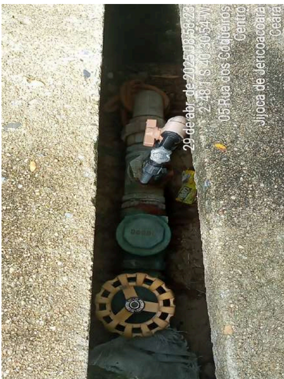
Foto 37 - PT-05 e PT-06: caixa de proteção do PT-05 assoreada e com acúmulo de resíduos sólidos.
