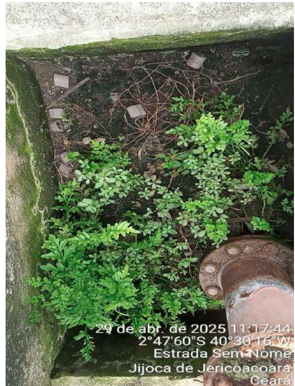
Foto 55 - ETE Antiga: caixa sem tampa de inspeção ou tampa fora do lugar; caixa assoreada com lodos e outros materiais, e com mato crescido.
