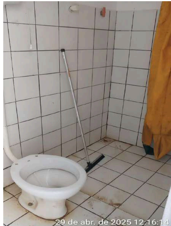
Foto 78 - EEE-01: banheiro com higiene precária.
