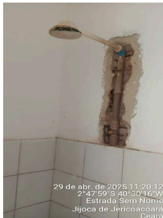
Foto 65 - Banheiro: instalações sanitárias e elétricas precárias sem higiene adequada.
