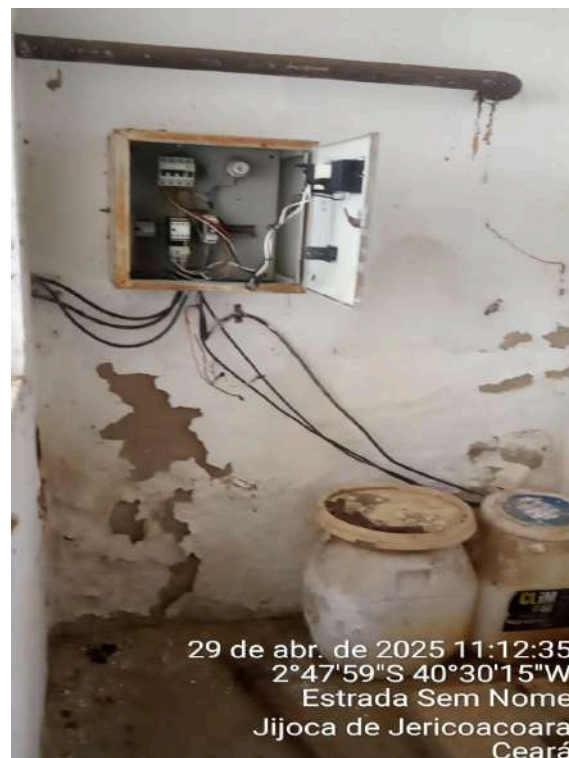
Foto 61 - Casa de sopradores: em manutenção, com piso e paredes danificados; instalações elétricas precárias.
