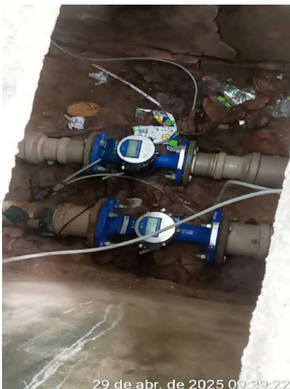
Foto 26 - EEAT-01 e RAP-01: macromedidores com caixa danificada ou sem tampa de proteção.
