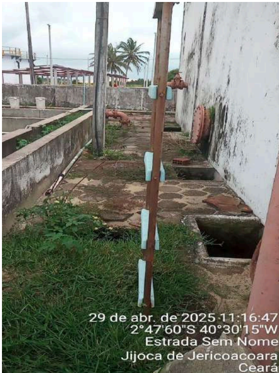
Foto 54 - ETE Antiga: caixas sem tampas de inspeção ou tampas fora do lugar; caixas assoreadas com lodos e outros materiais, e com mato crescido.
