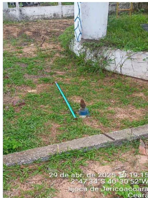
Foto 4 REL-01: registro sem caixa de proteção.
