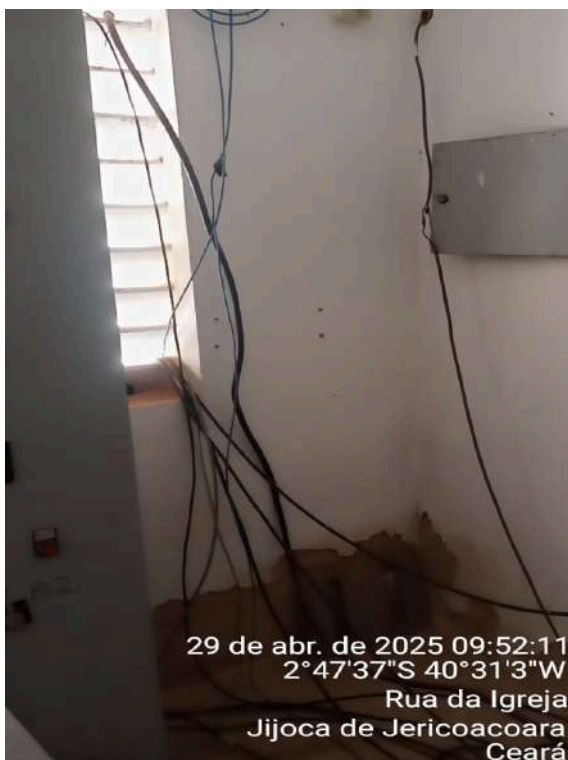
Foto 33 - EEAT-01: instalações elétricas inadequadas, sem eletrodutos de isolamento e proteção.
