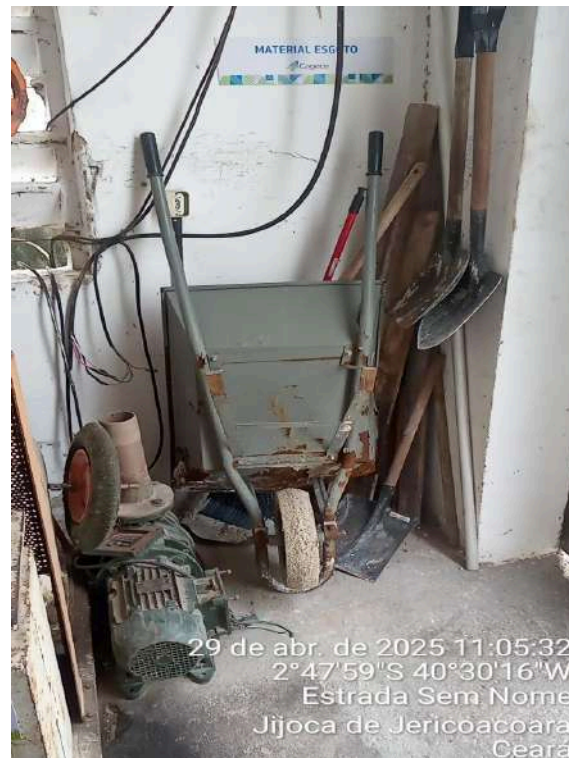
Foto 74 - EEE-02: materiais armazenados indevidamente na área de circulação da casa de bombas e do quadro de comandos.
