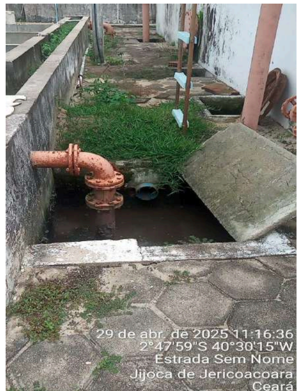
Foto 57 - ETE Antiga: caixas sem tampas de inspeção ou tampas fora do lugar; caixas assoreadas com lodos e outros materiais, e com mato crescido.
