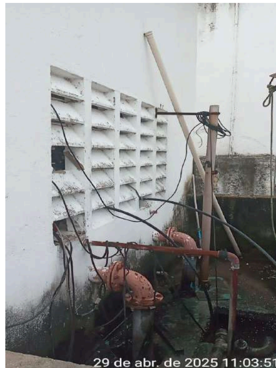
Foto 10 - EEE-02: instalações elétricas precárias, através de cobogós, com fios/cabos sem eletrodutos de proteção e isolamento no poço de sucção.
