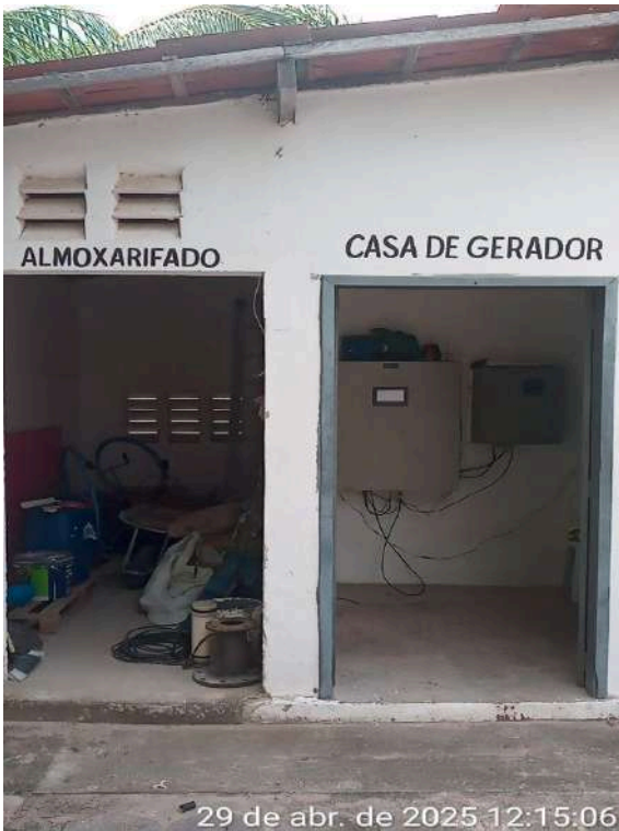
Foto 77 - EEE-01: almojarifado com armazenagem feita sem organização e controle; casa do grupo gerador e do quadro de comando com instalações elétricas precárias, sem eletroduto de proteção e isolamento.
