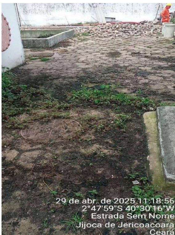
Foto 52 - ETE Antiga: pavimentação deteriorada e mato crescido.
