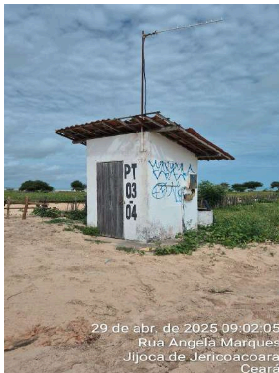
Foto 40 - PT-03 e PT-04: casa dos quadros de comando com pintura e telhado deteriorados.
