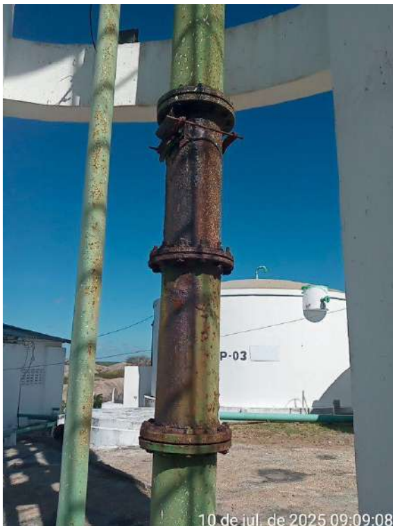
Foto 17 - REL-03 (Sede): apresenta tubulações e escada de acesso em processo de corrosão.
