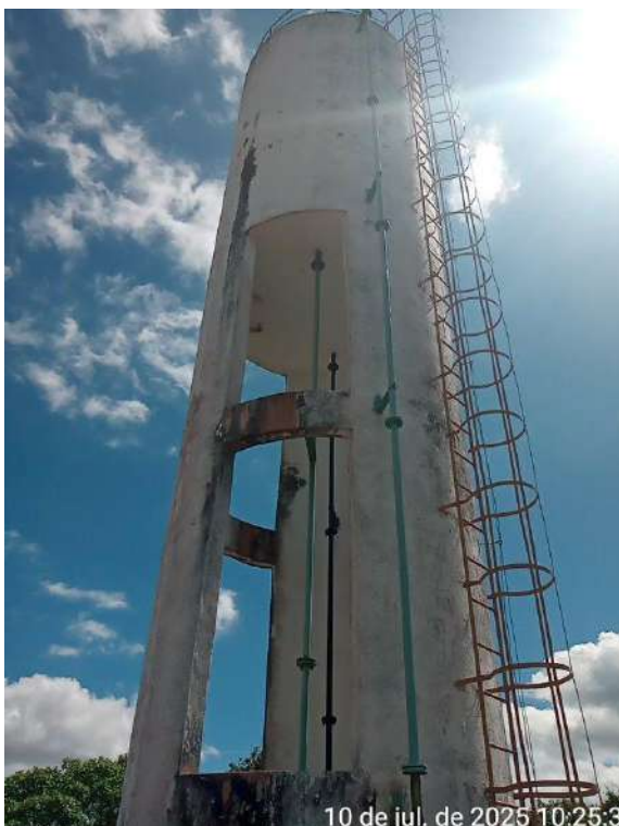
Foto 34 - REL-02 (Passagem): o reservatório apresenta vazamento e a escada de acesso encontra-se em processo de corrosão.
