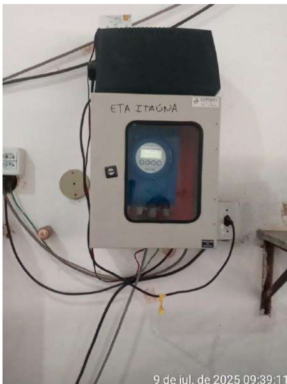
Foto 11 - EEAT-01 ( Sede ): fiação elétrica inadequada, sem eletrodutos de isolamento e proteção.
