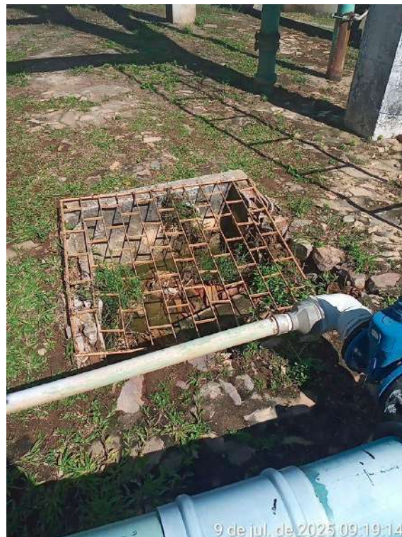
Foto 4 - ETA (Sede): caixa de passagem das águas de descargas e/ou lavagem dos filtros está deteriorada.
