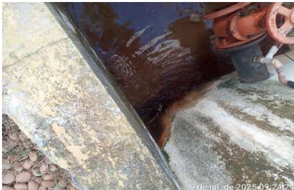
Foto 9 - RAP-01 (Sede): RAP-01 apresenta vazamento.
