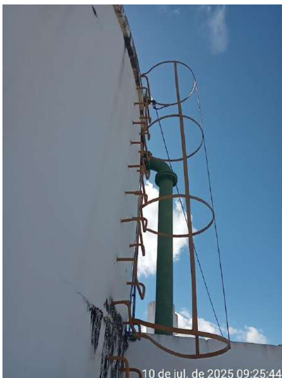
Foto 25 - RAP-03 (Sede): instalações elétricas inadequadas, presas à escada de acesso tipo marinho, que está inadequada, sem prolongamento do montante superior.
