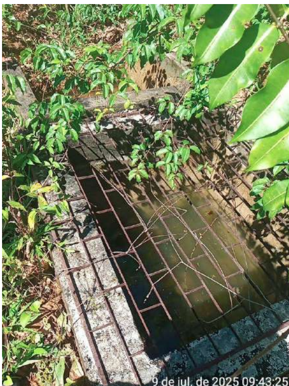
Foto 14 - ETA ( Sede ): a caixa de macromedição está inundada e com macromedidor submerso.
