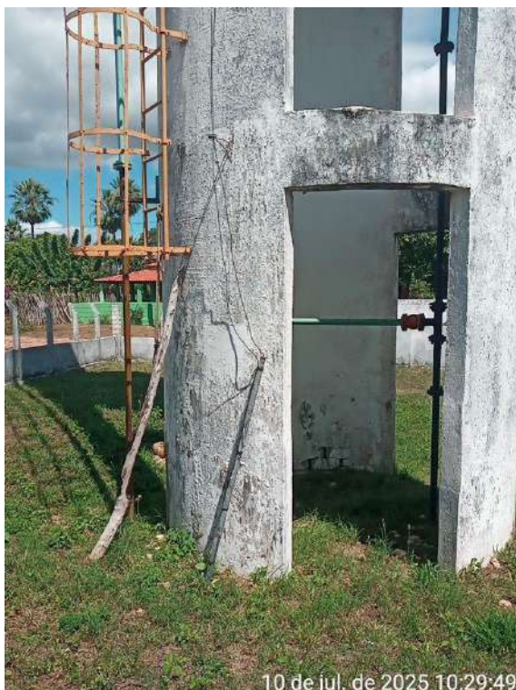
Foto 33 - REL-02 (Passagem): o pára-raios está com o cabo de descida inadequado, em contato com a infraestrutura.
