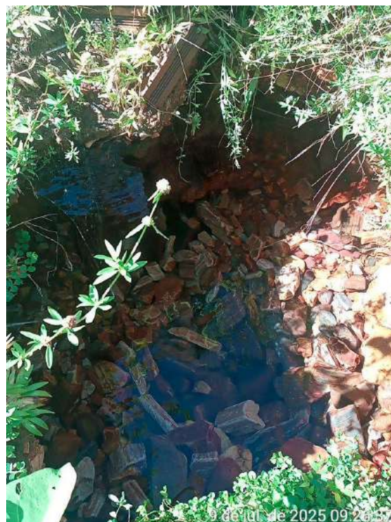
Foto 6 - ETA (Sede): caixa de passagem das águas de descarga e/ou lavagem dos reservatórios e de filtros está danificada.
