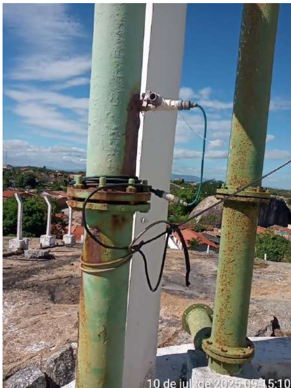
Foto 21 - REL-03 (Sede): apresenta instalações elétricas inadequadas, sem eletroduto de isolamento e proteção.
