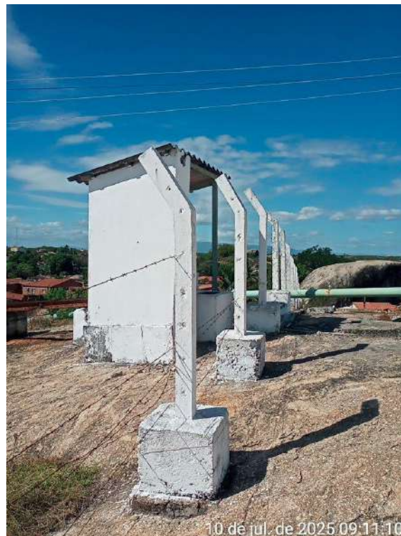
Foto 16 - EEAT-03/RAP-02/RAP/3/REL-03 (Sede): área tem cerca de isolamento e proteção danificada.
