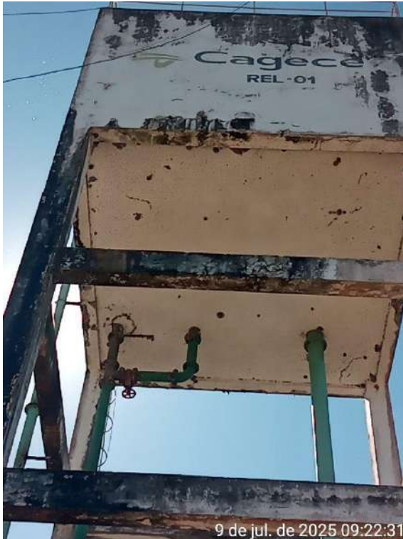
Foto 7 - REL-01 (Sede): encontra-se com pintura deteriorada, apresentando vazamento e sua escada está em processo de corrosão.
