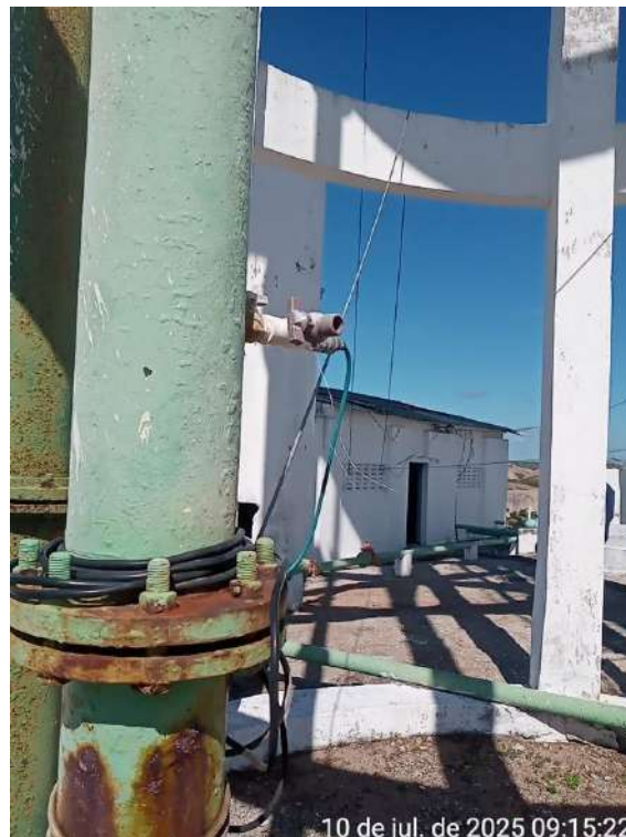
Foto 22 - REL-03 (Sede): apresenta instalações elétricas inadequadas, sem eletroduto de isolamento e proteção.
