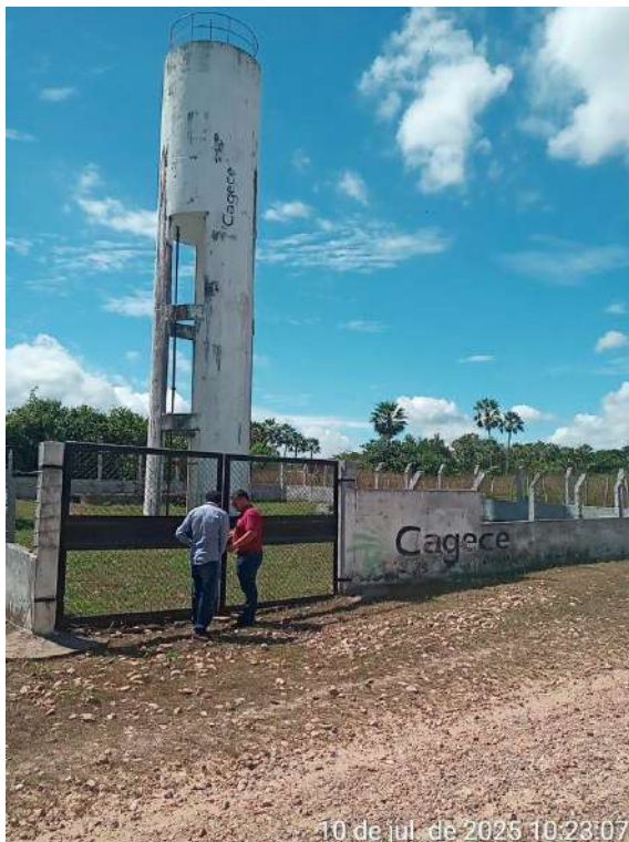
Foto 31 - REL-02 (Passagem): infraestrutura está com a pintura deteriorada.
