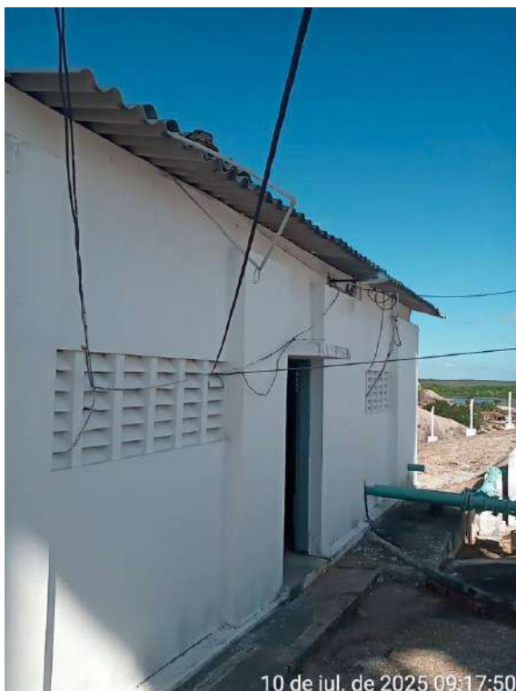
Foto 29 - EEAT-03 (Sede): instalações elétricas inadequadas, sem eletroduto de isolamento e proteção, instaladas através de cobogós.
