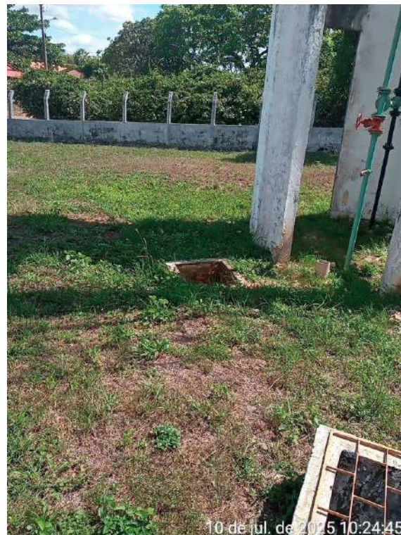
Foto 32 - REL-02 (Passagem): caixa de inspeção de registro sem tampa e um registro sem caixa de proteção.
