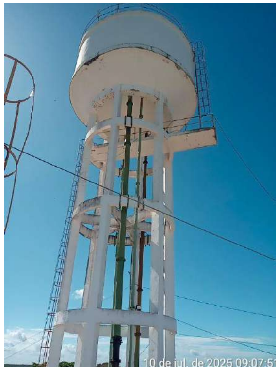
Foto 18 - REL-03 (Sede): estrutura está sem para-raio.
