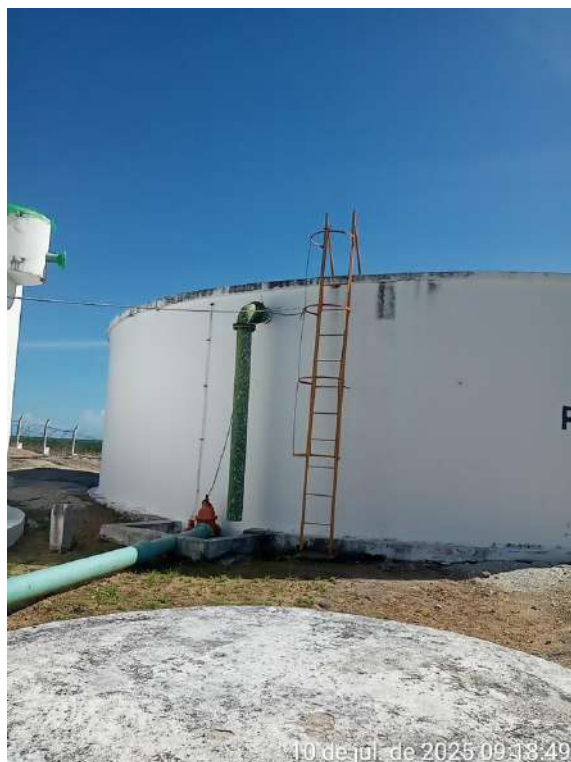
Foto 23 - RAP-02 (Sede): o não tem grade de proteção / guarda-corpos, instalações elétricas inadequadas, presas à escada de acesso que se encontra em processo de corrosão.
