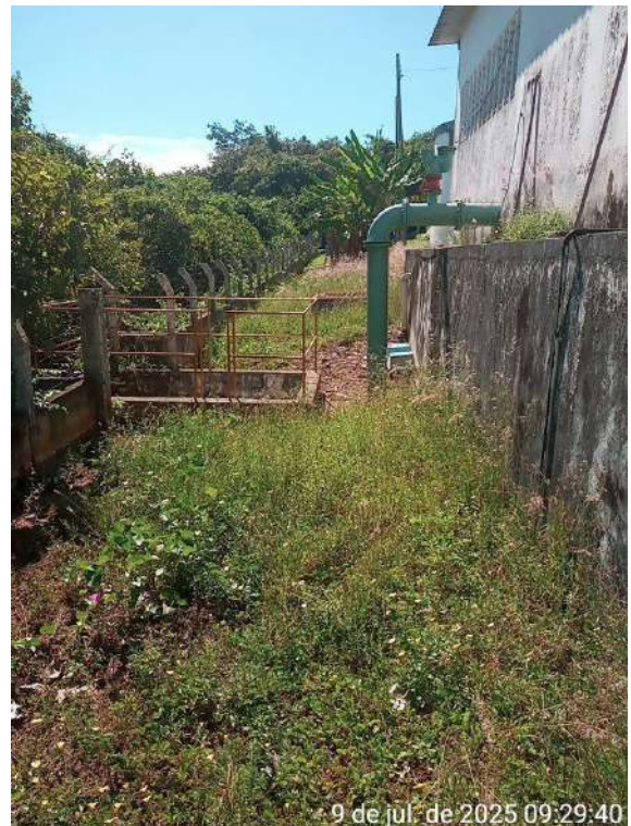
Foto 2 - ETA (Sede): a área do pátio está com a vegetação crescida.
