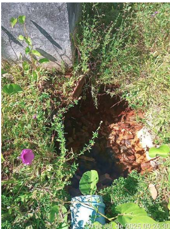
Foto 5 - ETA (Sede): caixa de passagem das águas de descarga e/ou lavagem dos reservatórios e de filtros está danificada.
