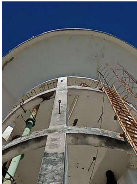
Foto 20 - REL-03 (Sede): apresenta armaduras expostas e em processo de corrosão.
