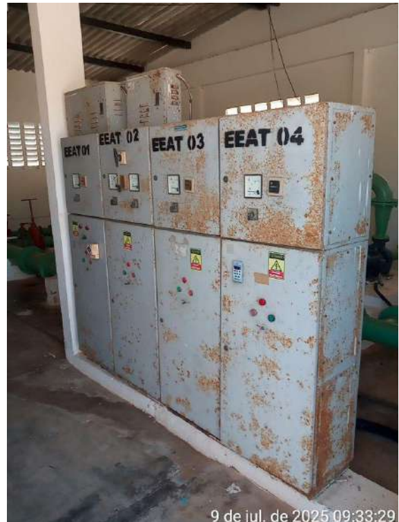
Foto 10 - EEAT-01 (Sede): quadros de comando das estações em processo de corrosão.
