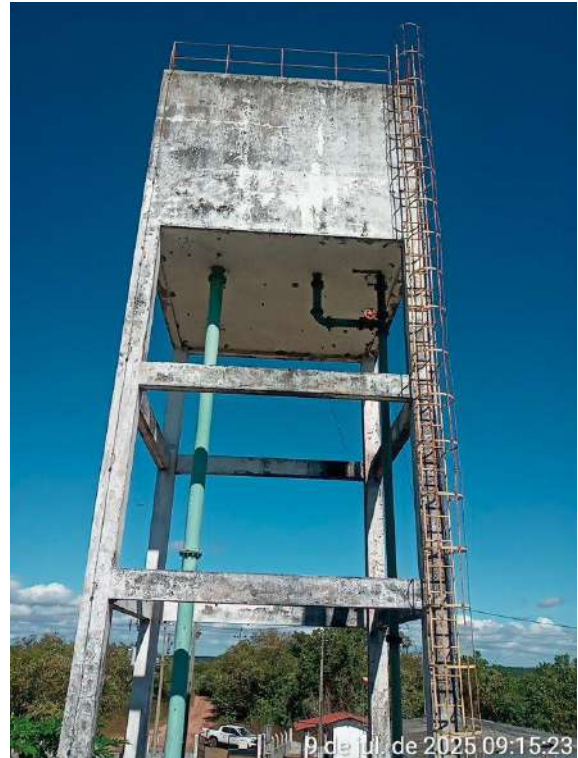
Foto 8 - REL-01 (Sede): encontra-se com pintura deteriorada, apresentando vazamento e sua escada está em processo de corrosão.
