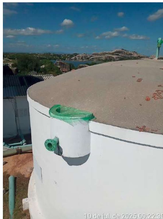
Foto 24 - RAP-03 (Sede): o reservatório não tem grade de proteção / guarda-corpos e a abertura de inspeção está sem tampa com fechamento hermético.
