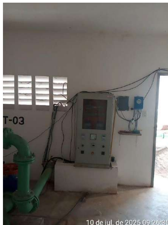
Foto 26 - EEAT-03 (Sede): instalações elétricas inadequadas, sem eletroduto de isolamento e proteção.
