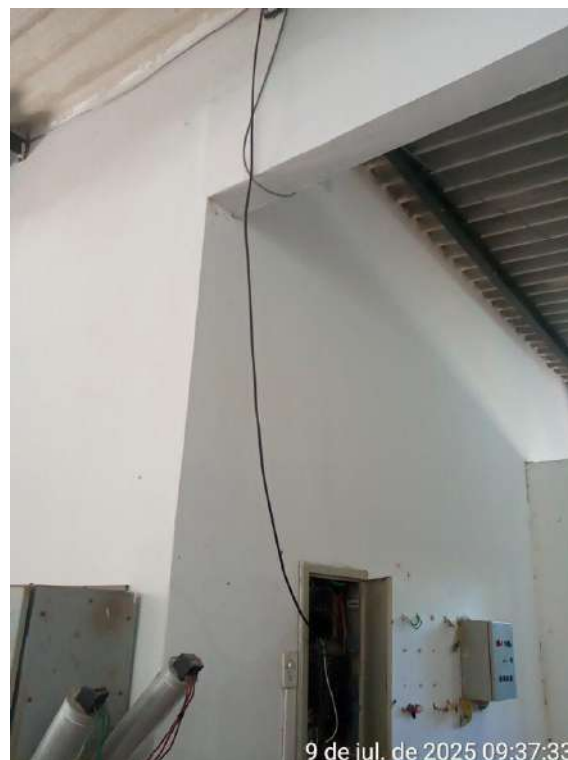
Foto 12 - EEAT-01 ( Sede ): fiação elétrica inadequada, sem eletrodutos de isolamento e proteção.
