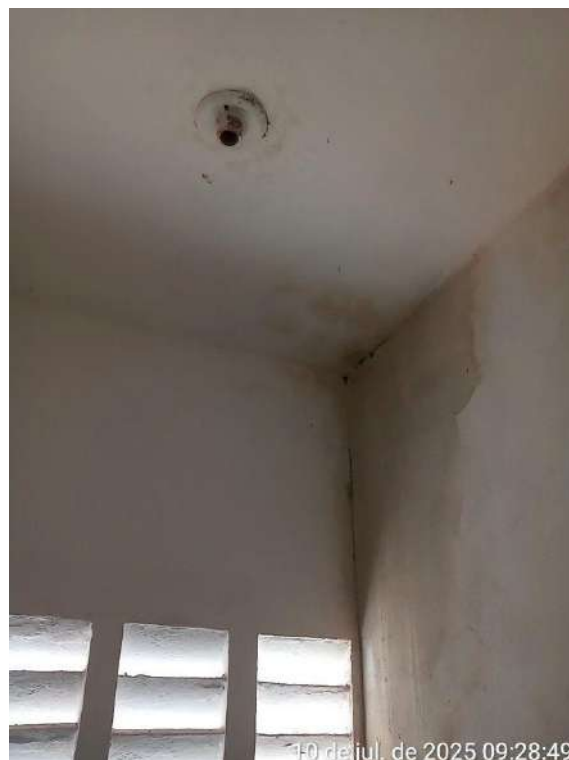
Foto 30 - EEAT-03 (Sede): o banheiro não tem lâmpada e seu revestimento não é do tipo lavável que favoreça a limpeza e higiene.
