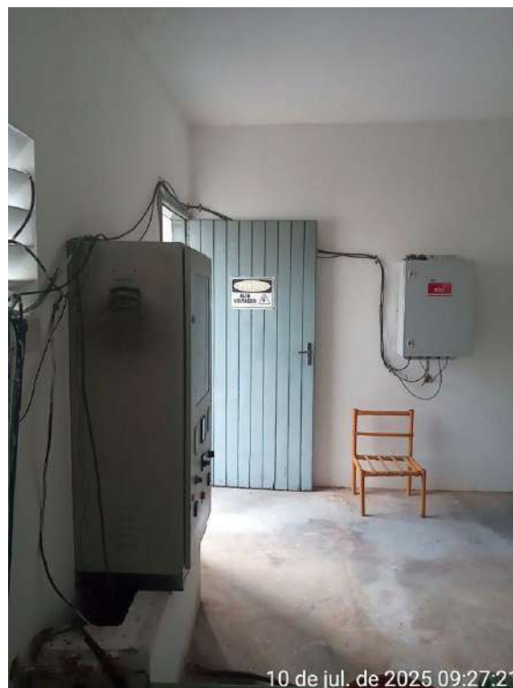
Foto 28 - EEAT-03 (Sede): instalações elétricas inadequadas, sem eletroduto de isolamento e proteção.
