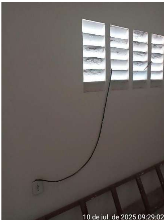
Foto 27 - EEAT-03 (Sede): instalações elétricas inadequadas, sem eletroduto de isolamento e proteção, instaladas através de cobogó.
