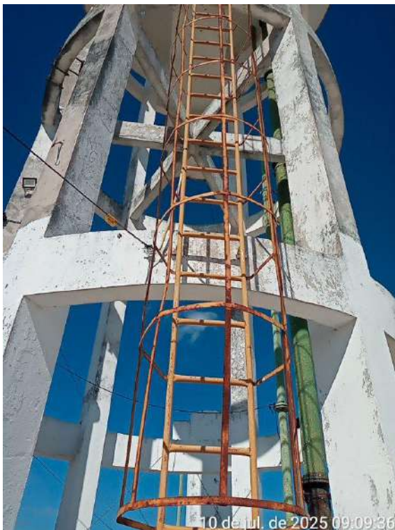
Foto 19 - REL-03 (Sede): apresenta tubulações e escada de acesso em processo de corrosão, estrutura exposta.
