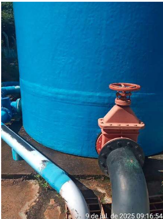
Foto 3 - ETA (Sede): o filtro F-03 está com vazamento na base.
