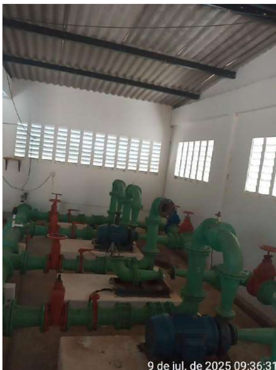
Foto 13 - EEAT-01 ( Sede ): bombeamento sem as duas bombas reservas.
