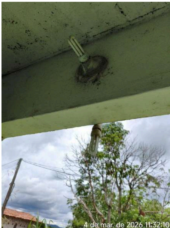
Foto 41 - Sede PT-17: lâmpada externa danificada.
