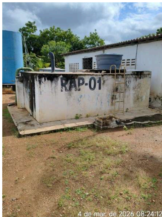
Foto 71 - Iara RAP-01: pintura deteriorada e não possui grade de proteção / guarda corpo na laje de cobertura.
