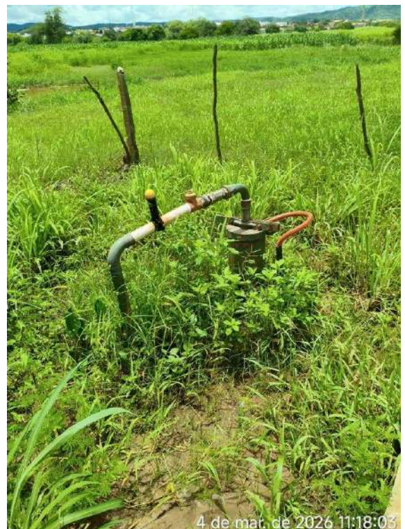
Foto 38 - Sede PT-05: cerca de proteção danificada; área com vegetação crescida.
