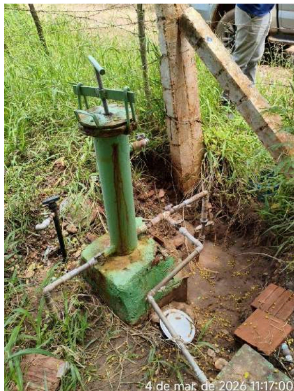
Foto 37 - Sede PT-05: base da instalação de cloro erodida pela água.
