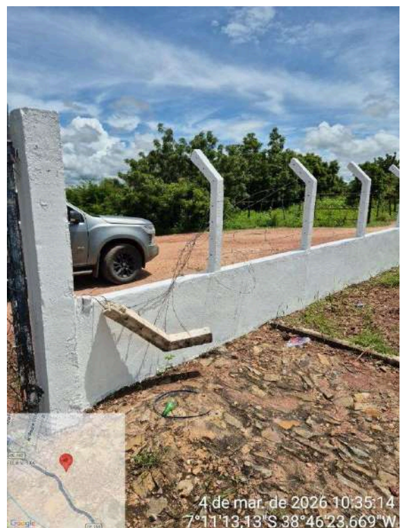
Foto 57 - Sede RAP-03: cerca da mureta danificada.
