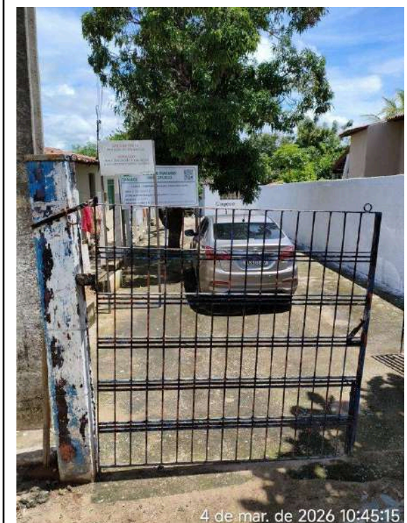
Foto 49 - Sede ETA: infraestrutura de acesso necessitando de reparos e pintura.
