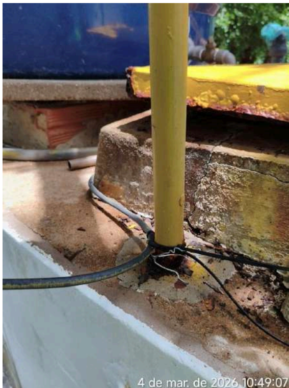
Foto 60 - Sede RAP-01: cabos/fios instalados presos à escada e através da abertura de inspeção, sem eletroduto.
