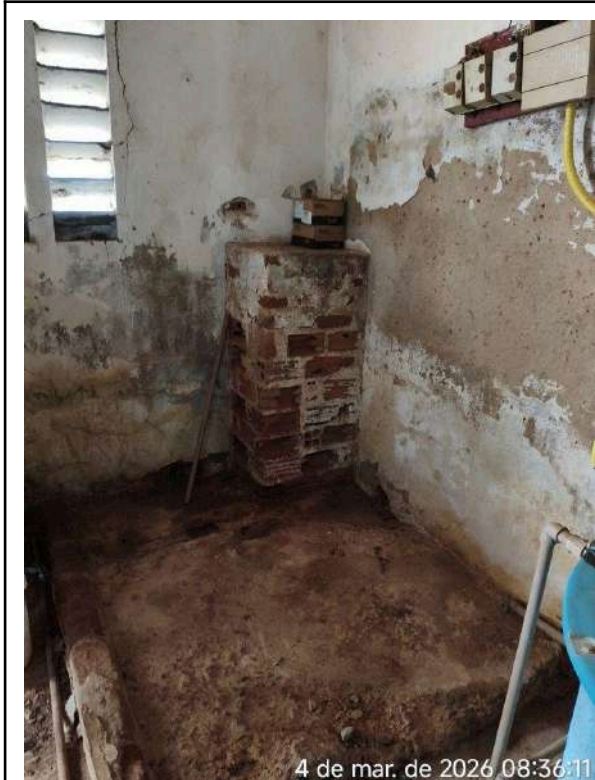
4 de mar. de 2026 08:36:11 Foto 73 - lara Casa de Química: parede e piso deteriorados.
