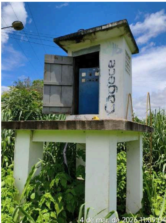
Foto 7 - Sede PT-03: plataforma de acesso ao quadro de comando sem grade de proteção na laje.
