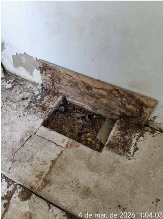
Foto 5 - Sede PT-14: caixa de passagem de energia localizada no piso está sem tampa adequada.
