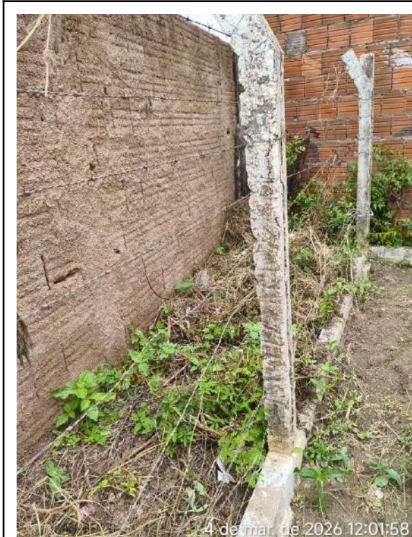
Foto 47 - Sede PT-11: pintura deteriorada e cerca danificada.
