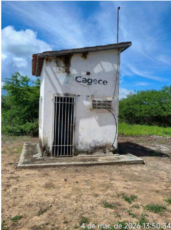
Foto 21 - Sede Casa do operador: não há energia elétrica disponível e nem iluminação interna e externa.
