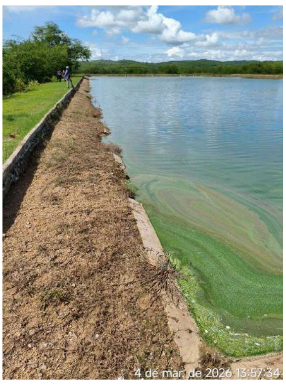
Foto 92 - Sede ETE_Lagoas: meios-fios, placas de proteção e taludes das lagoas estão deteriorados e desmoronando.
