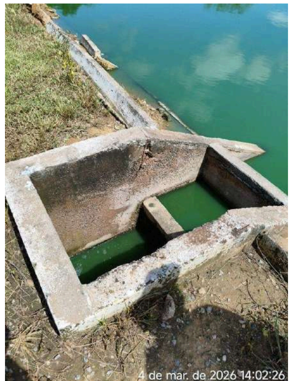
Foto 26 - Sede Taludes: caixa sem tampa de proteção na área de circulação do talude.
