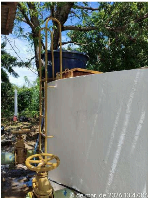
Foto 15 - Sede RAP-01: reservatório sem grade de proteção na laje superior.
