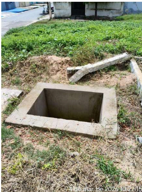
Foto 3 - Sede PT-09: caixa de inspeção em frente às instalações está sem tampa.
