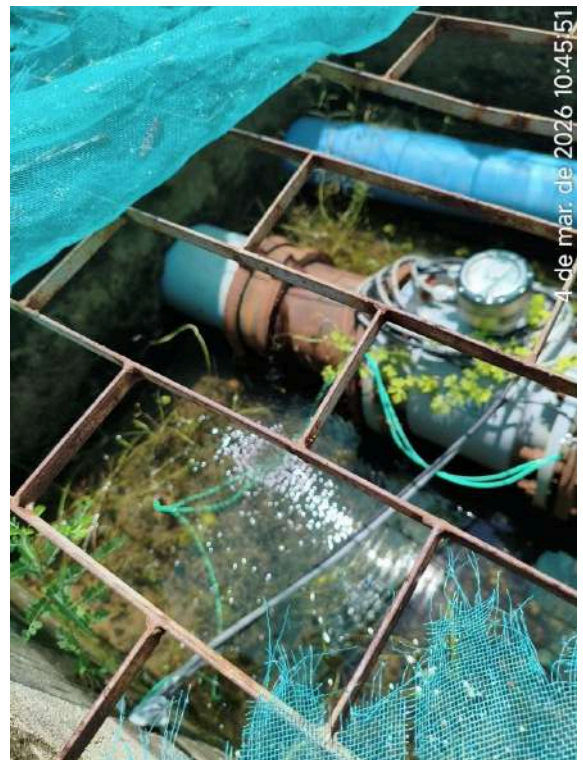
Foto 61 - Sede Adutora: a tubulação apresenta vazamento.
