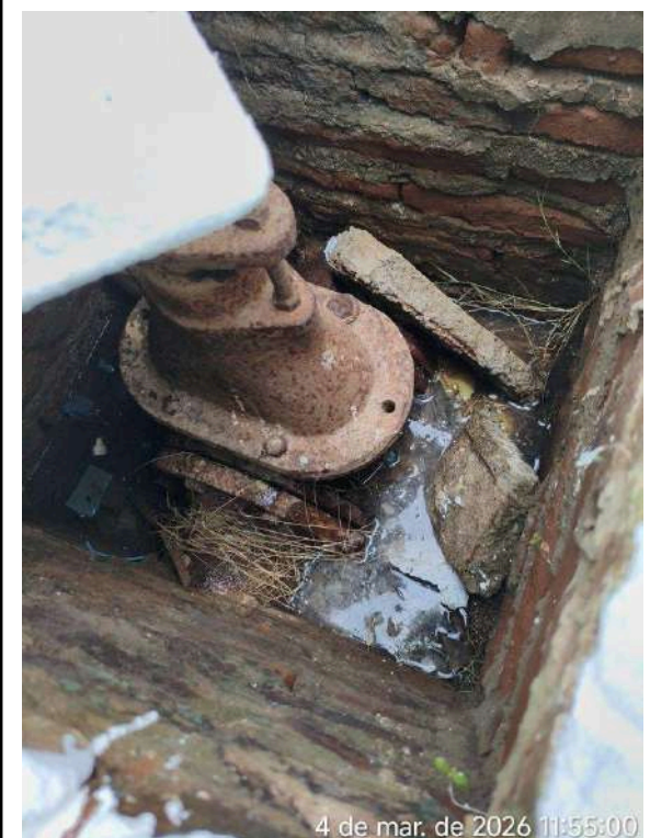
Foto 68 - Sede RAP-02: registro com vazamento.
