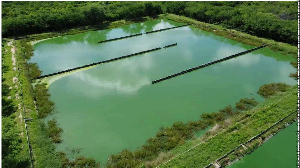
Foto 94 - Sede ETE_Lagoas: foi observada a presença de vegetação aquática dentro das lagoas de maturação e vegetação crescida em cima dos taludes.
