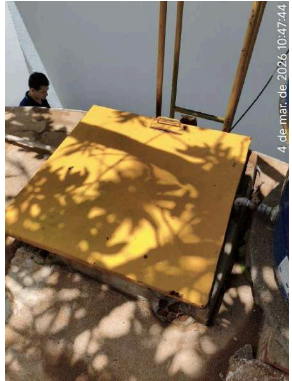
Foto 59 - Sede RAP-01: tubulação hidráulica instalada através da abertura de inspeção.
