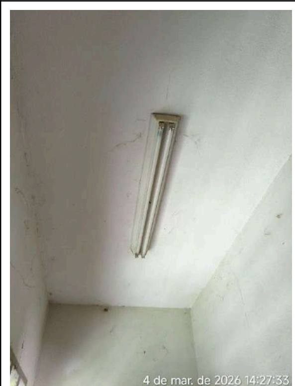
4 de mar. de 2026 14:27:33 Foto 81 - Sede EEE-01_Casa do Quadro de Comando: luminária com lâmpadas queimadas.
