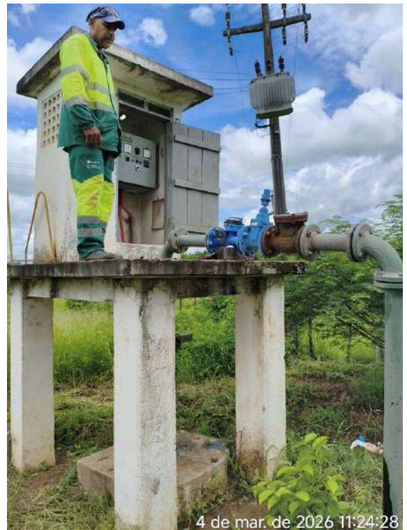
Foto 12 - Sede PT-04: plataforma sem grade de proteção.
