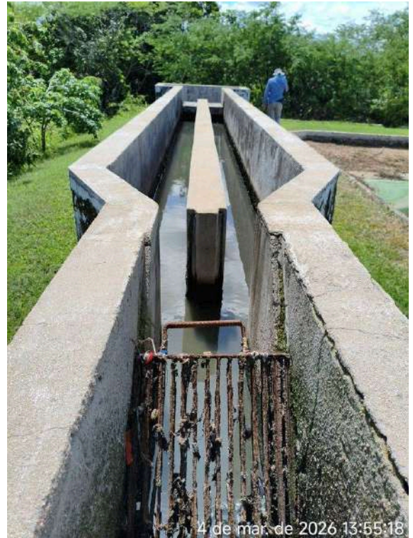
Foto 22 - Sede Caixas de areia: não possuem comportas de uso na operação e manutenção (stop log).
