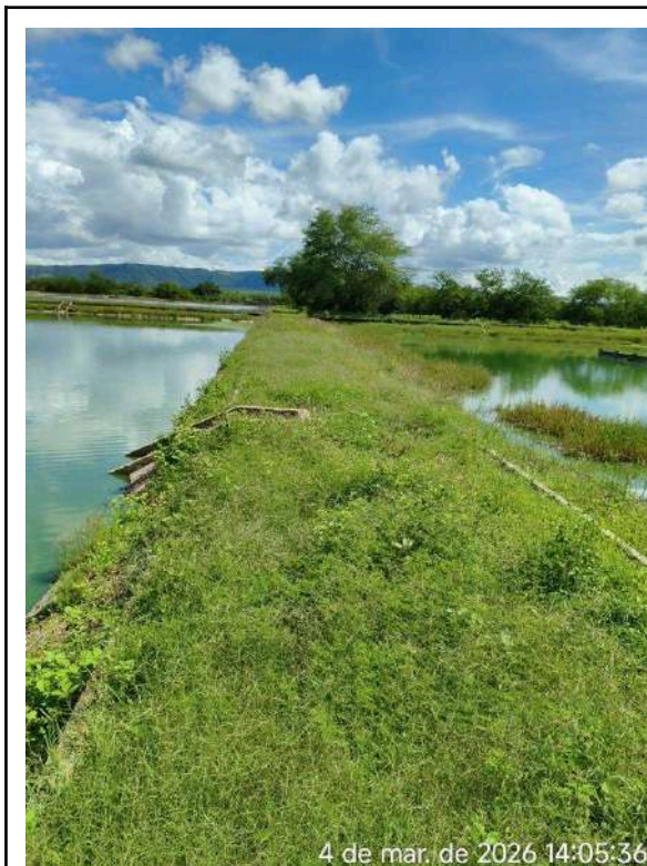
Foto 25 - Sede Taludes: vegetação crescida em cima do talude; caixa sem tampa de proteção na área de circulação do talude.
