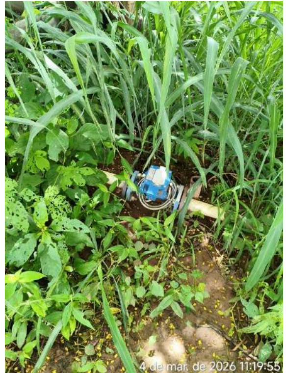
Foto 10 - Sede PT-05: macromedidor sem caixa de proteção e inspeção.
