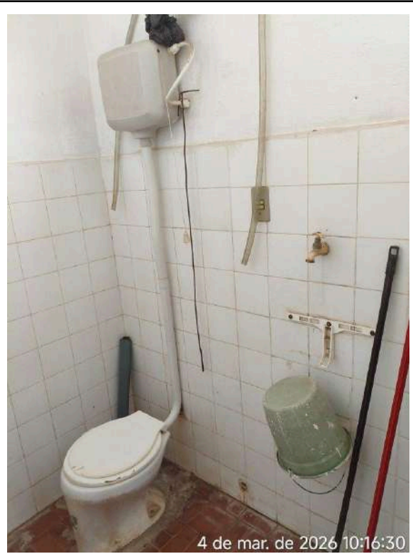
Foto 55 - Sede REL-01: banheiro em condições precárias.
