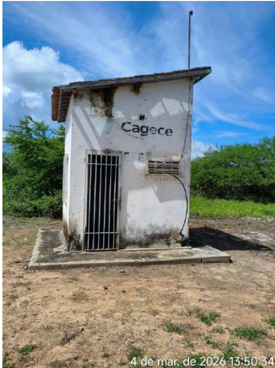
4 de mar. de 2026 13:50:34 Foto 85 - Sede ETE_Casa do operador: pintura deteriorada; presença de uma colmeia.
