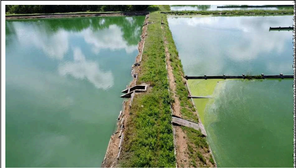
Foto 93 - Sede ETE_Lagoas: meios-fios, placas de proteção e taludes das lagoas estão deteriorados e desmoronando.
