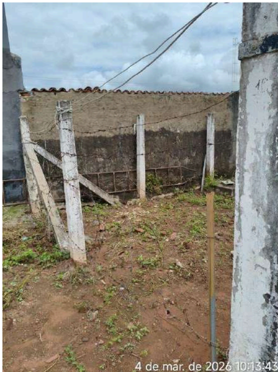
Foto 52 - Sede REL-01: cerca de proteção danificada,
