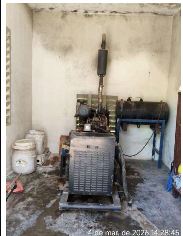
4 de mar. de 2026 14:28:45 Foto 83 - Sede EEE-01_Sala do Grupo Gerador: equipamento parado.
