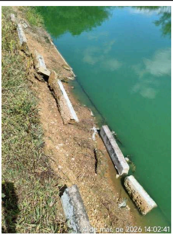
Foto 90 - Sede ETE_Lagoas: meios-fios, placas de proteção e taludes das lagoas estão deteriorados e desmoronando.
