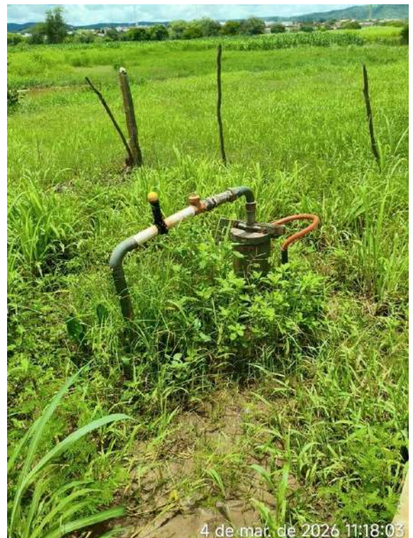
Foto 8 - Sede PT-05: ausência de laje de proteção do poço.
