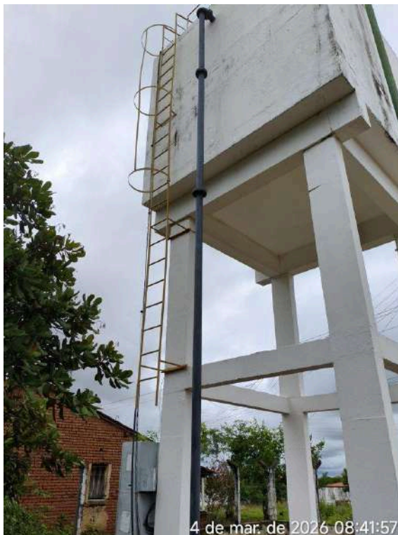
Foto 19 - lara REL-01: escada tipo marinheiro inadequada.
