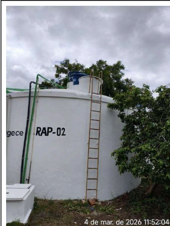
Foto 17 - Sede RAP-02: escada tipo marinheiro sem gaiola e sem grade de proteção na laje.
