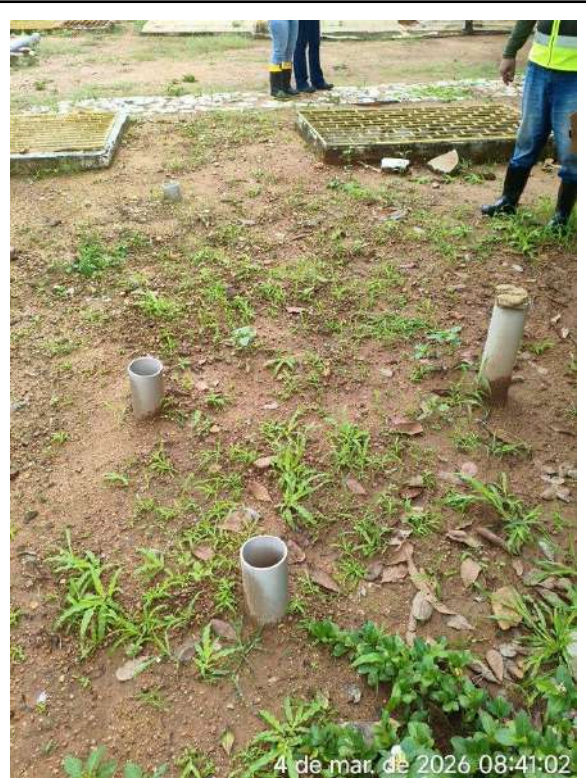
Foto 18 - lara Pátio: registro sem caixa de proteção.
