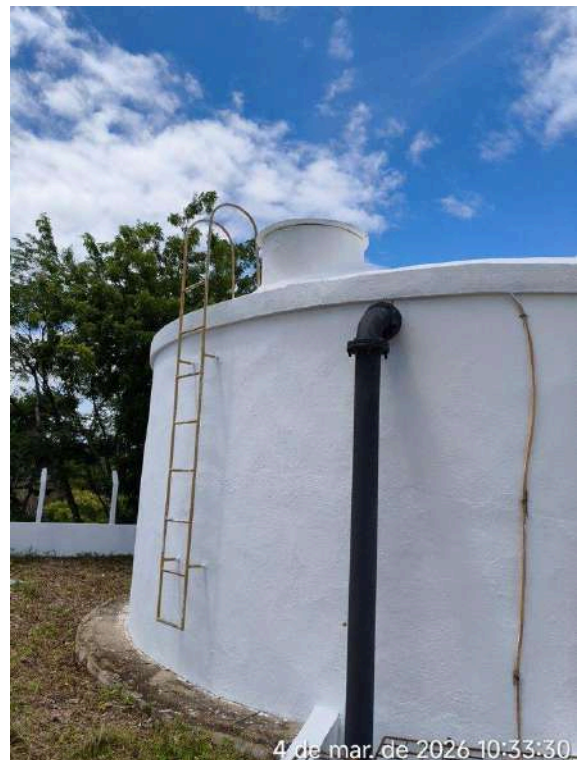
Foto 16 - Sede RAP-03: escada tipo marinheiro sem gaiola e sem grade de proteção na laje.
