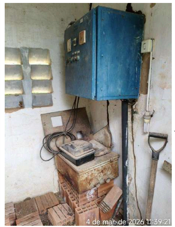
Foto 46 - Sede PT-06: poço desativado, com instalações vulneráveis pelo comprometimento da proteção ao acesso.
