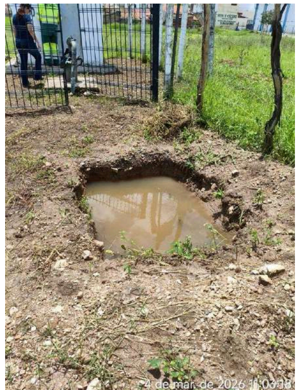
Foto 4 - Sede PT-14: caixa inacabada em frente ao prédio.
