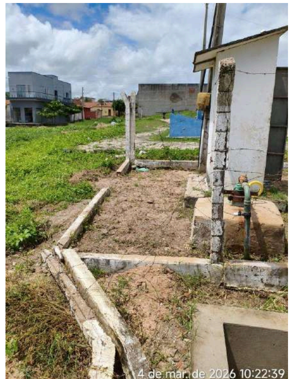
Foto 30 - Sede PT-09: cerca de proteção danificada.
