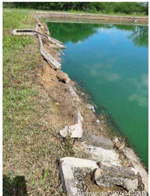
Foto 24 - Sede Taludes: caixa sem tampa de proteção na área de circulação do talude; erosão do talude e placas de proteção deterioradas.
