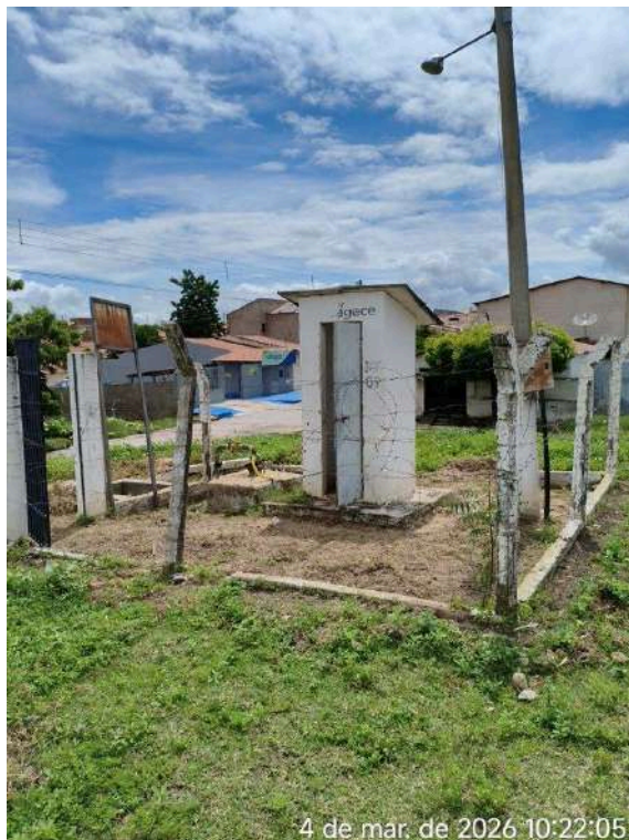
Foto 29 - Sede PT-09: pintura e identificação desgastada.
