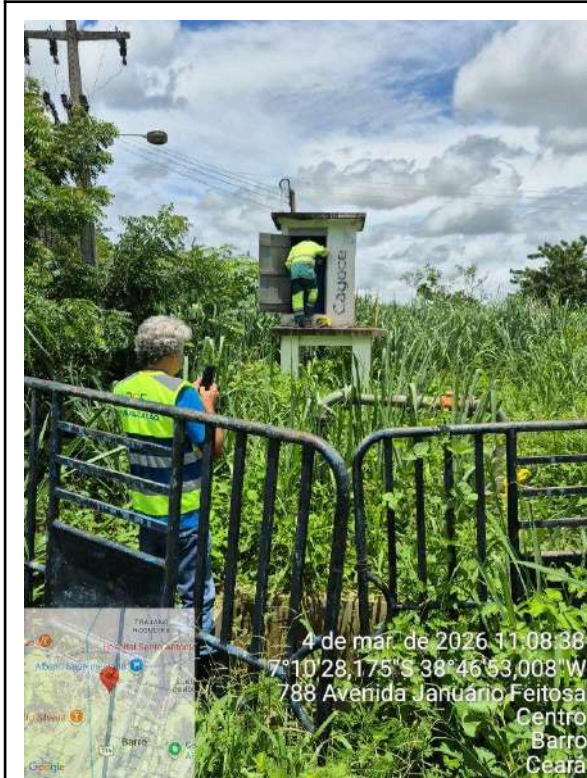
Foto 35 - Sede PT-03: pintura e identificação desgastada; portão de acesso danificado e área tomada pela vegetação.
