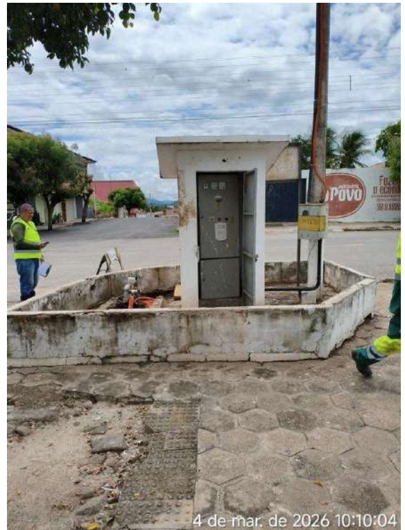
Foto 2 - Sede PT-12: o poço não possui proteção contra acesso físico.
