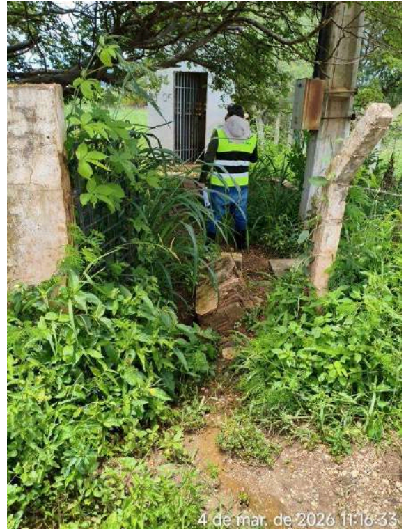
Foto 36 - Sede PT-05: portão de acesso e cerca de proteção danificados.
