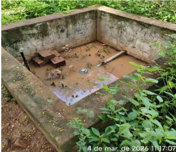
Foto 9 - Sede PT-05: caixas de proteção e inspeção sem tampas.
