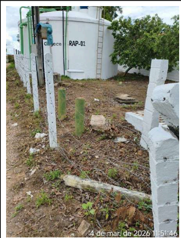
Foto 66 - Sede RAP-02: cerca danificada.
