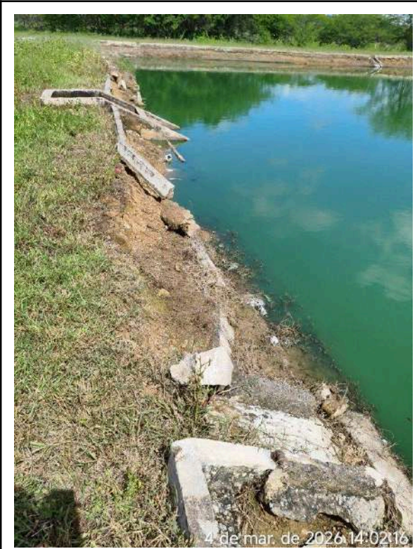
Foto 89 - Sede ETE_Lagoas: meios-fios, placas de proteção e taludes das lagoas estão deteriorados e desmoronando.
