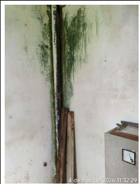
Foto 43 - Sede PT-17: casa do quadro de comandos com pintura deteriorada.
