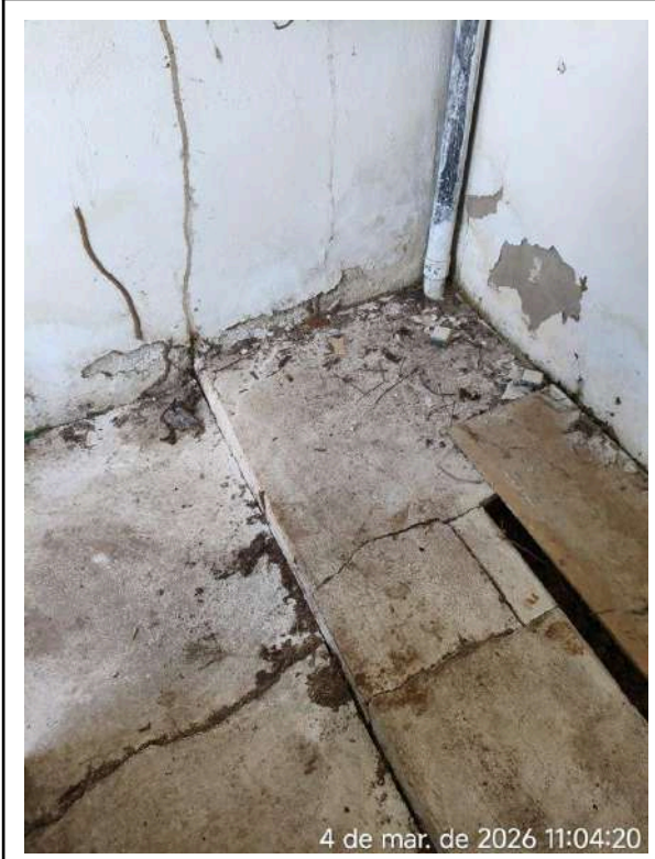
Foto 33 - Sede PT-14: presença de sujeira e cupins na parede.
