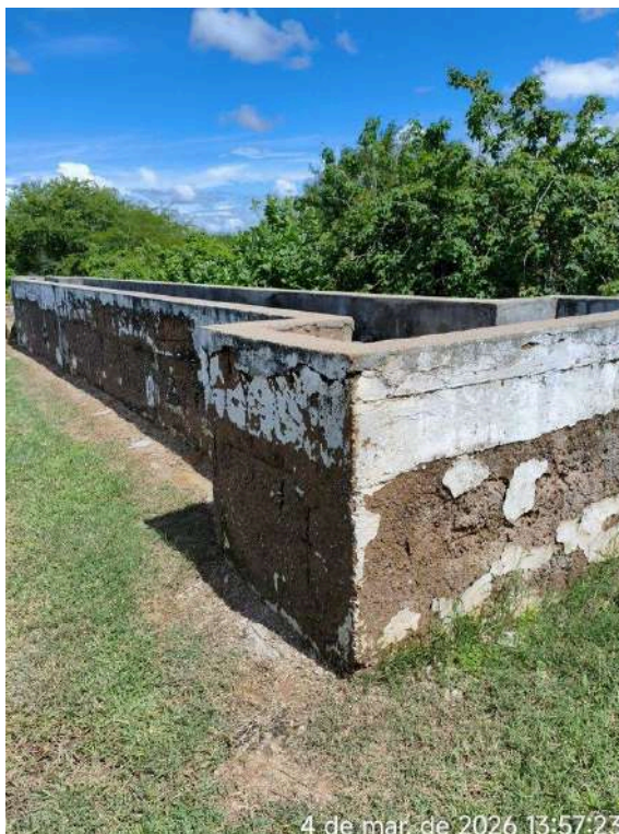
4 de mar. de 2026 13:57:23 Foto 87 - Sede ETE_Tratamento Preliminar: apresenta anomalias, com concreto degradado e ferragens em processo de corrosão.
