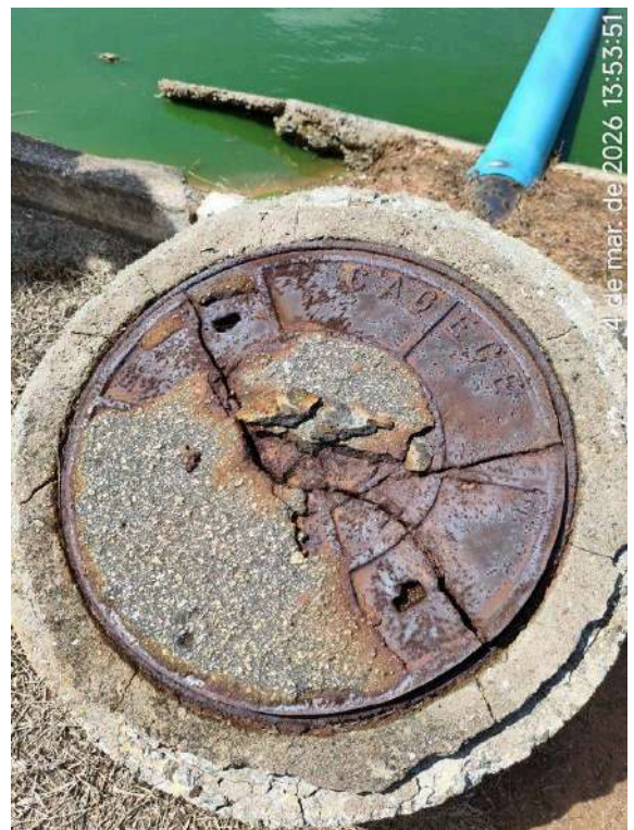
4 de mar. de 2026 13:53:51 Foto 88 - Sede ETE_Lagoas: apresenta tampa danificada por corrosão.
