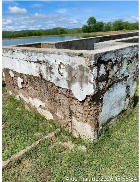
4 de mar. de 2026 13:55:54 Foto 86 - Sede ETE_Tratamento Preliminar: apresenta anomalias, com concreto degradado e ferragens em processo de corrosão.
