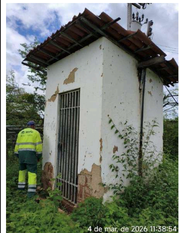
Foto 45 - Sede PT-06: poço desativado, com instalações vulneráveis pelo comprometimento da proteção ao acesso.
