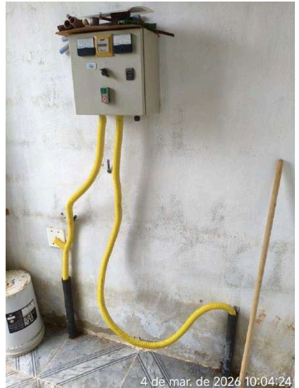
Foto 28 - Sede PT-18: material armazenado em cima do quadro de comando.
