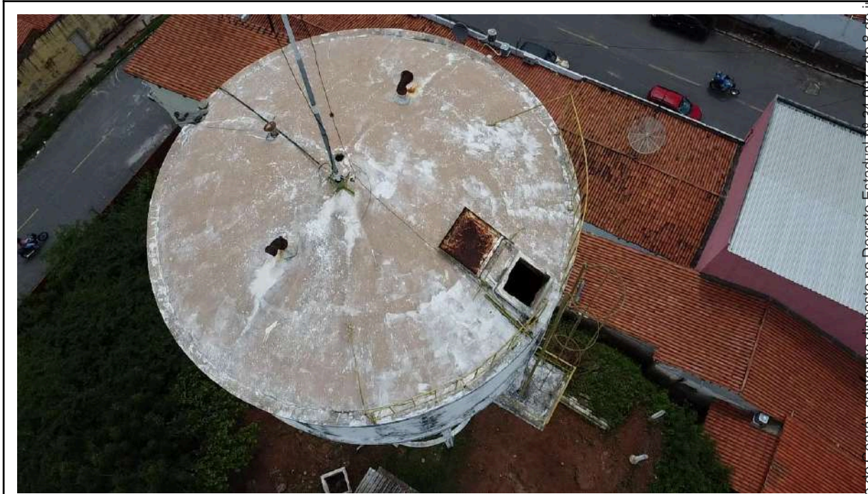
Foto 51 - Sede REL-01: tampa do reservatório aberta e em processo de corrosão.
