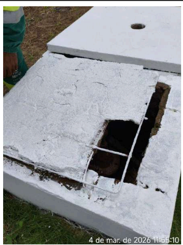
Foto 67 - Sede RAP-02: tampa da caixa danificada.
