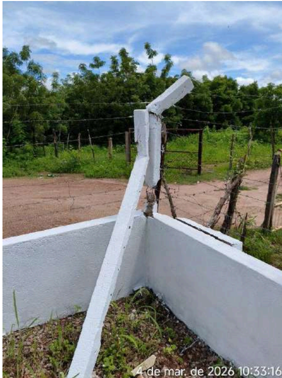
Foto 58 - Sede RAP-03: cerca da mureta danificada.
