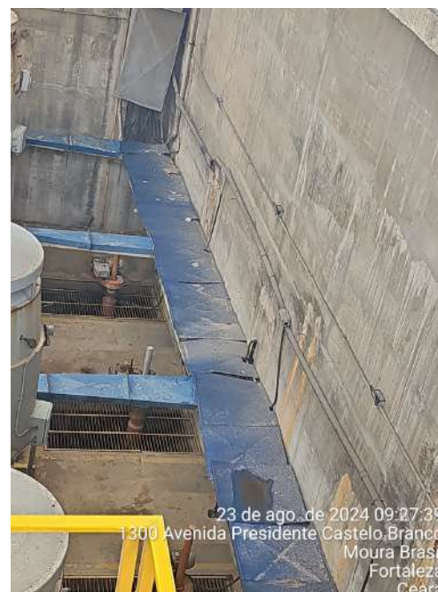
Foto 4 - Estação Elevatória EEE-1: a terceira bomba está em manutenção e a eletrocalha (estrutura metálica azul) oferece risco ao operador.
