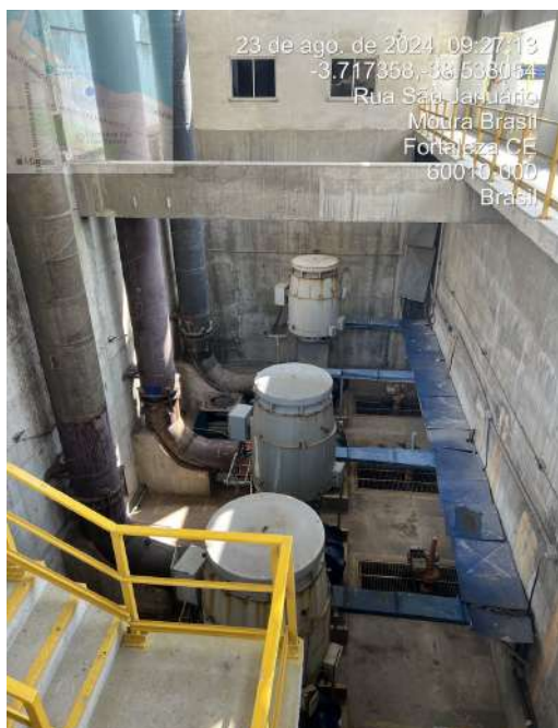
Foto 3 - Estação Elevatória EEE-1: a terceira bomba está em manutenção e a eletrocalha (estrutura metálica azul) oferece risco ao operador.
