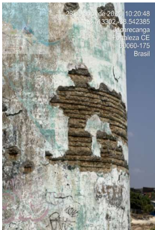
Foto 13 - Torre de Equilíbrio: estrutura comprometida; armação exposta; escada corroída e pintura deteriorada. Sem operação.
