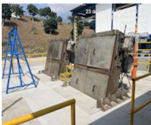
Foto 1 - Gradeamento: apenas uma grade está operando, a outra encontra-se parada.
