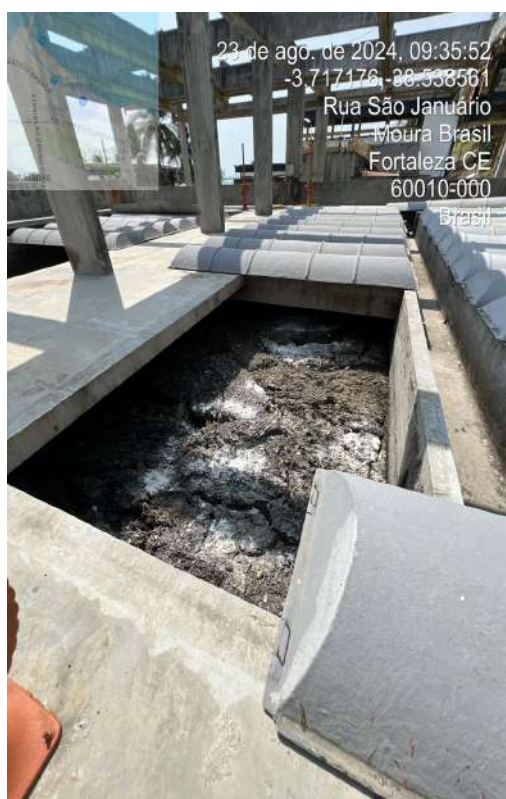
Foto 8 - Desarenadores: ausência de tampas; a frequência de limpeza não está sendo realizada conforme o Manual de Operação e Manutenção (a cada 15 dias).
