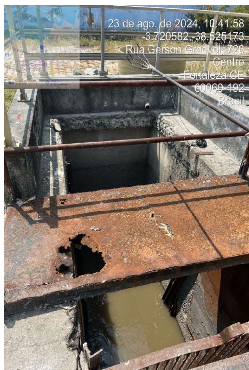
Foto 16 - EEE-EMIL: estrutura comprometida; pintura deteriorada e passarela de acesso oferece risco ao operador.
