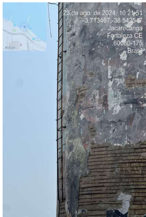
Foto 14 - Torre de Equilíbrio: estrutura comprometida; armação exposta; escada corroída e pintura deteriorada. Sem operação.
