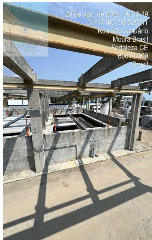
Foto 10 - Desarenadores: ausência de tampas; a frequência de limpeza não está sendo realizada conforme o Manual de Operação e Manutenção (a cada 15 dias).
