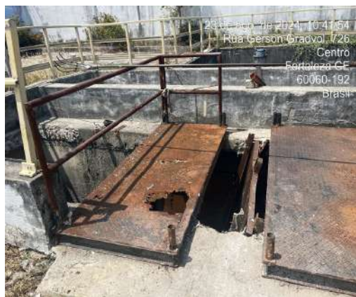
Foto 18 - EEE-EMIL: estrutura comprometida; pinturas deterioradas e passarela de acesso oferecem risco ao operador.
