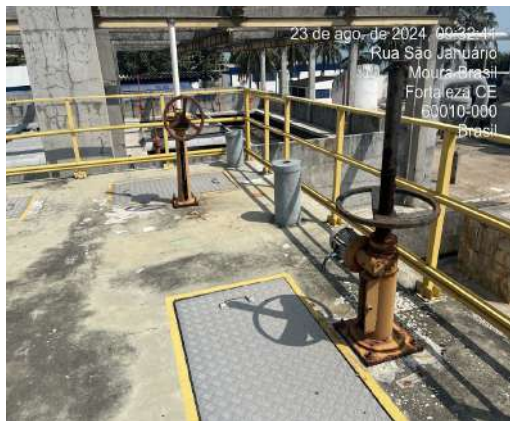
Foto 5 - Peneiramento: inexistência de peneiras; estrutura corroída; estrutura sem efeito ao tratamento
