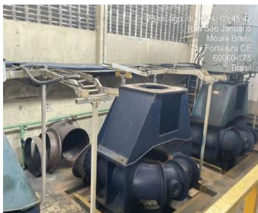
Foto 11 - Estação Elevatória EE-2: bomba 3 está inoperante.
