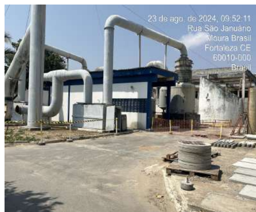
Foto 12 - Estação de Tratamento de Odores - ETO: não está operando.
