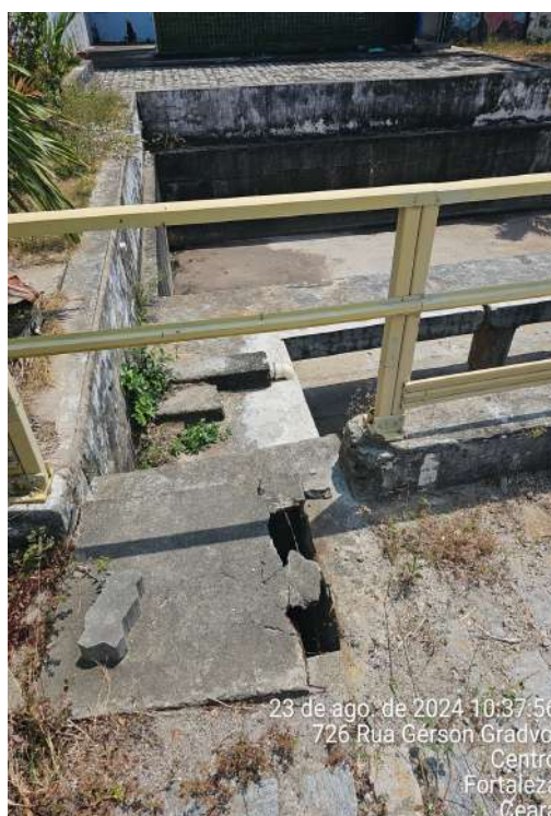
Foto 15 - EEE-EMIL: estrutura comprometida; pintura deteriorada e passarela de acesso oferece risco ao operador.
