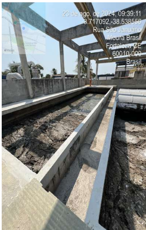
Foto 9 - Desarenadores: ausência de tampas; a frequência de limpeza não está sendo realizada conforme o Manual de Operação e Manutenção (a cada 15 dias).
