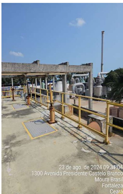
Foto 7 - Peneiramento: inexistência de peneiras; estrutura corroída; estrutura sem efeito ao tratamento. Ao fundo, ETO desativada e sem efeito.
