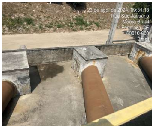
Foto 6 - Peneiramento: inexistência de peneiras; estrutura corroída; estrutura sem efeito ao tratamento.
