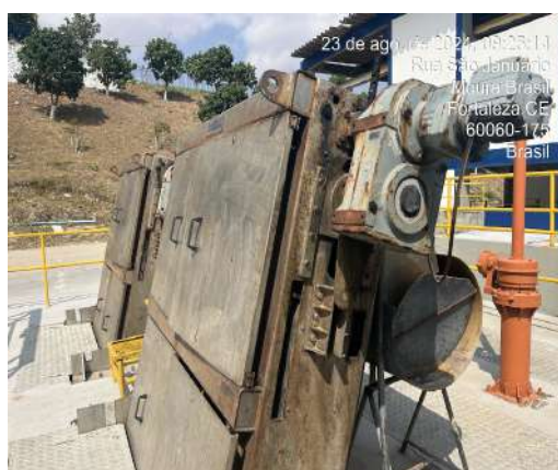
Foto 2 - Gradeamento: apenas uma grade está operando, a outra encontra-se parada.
