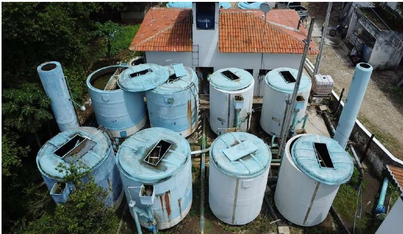
Foto 14 - ETA Redenção (filtros): tampas deslocadas ou ausentes.
