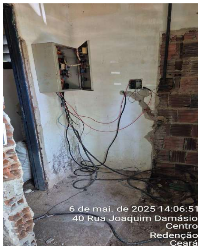
Foto 26 - EERD-02: fiação inadequada, sem eletroduto de proteção e isolamento; parede sem reboco.
