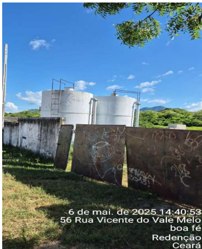
Foto 48 - ETE Redenção (Boa Fé): portão de acesso danificado e com pintura deteriorada.
