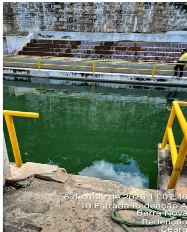
Foto 2 - ETA Redenção (floculadores/decantadores): ausência de corrimão.
