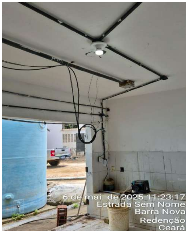
Foto 6 - ETA Redenção (casa de química): fiação inadequada.
