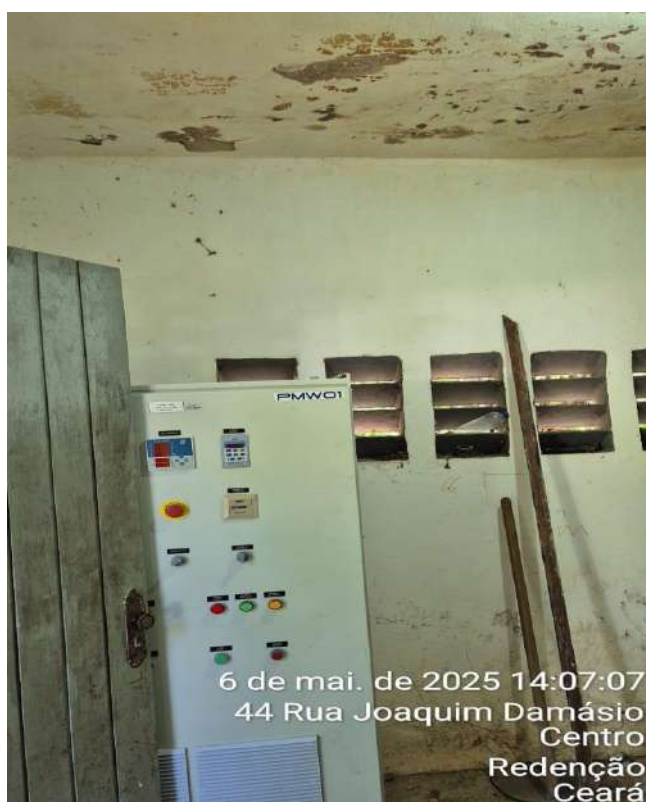
Foto 29 - EERD-02: teto com rachaduras e pintura deteriorada.
