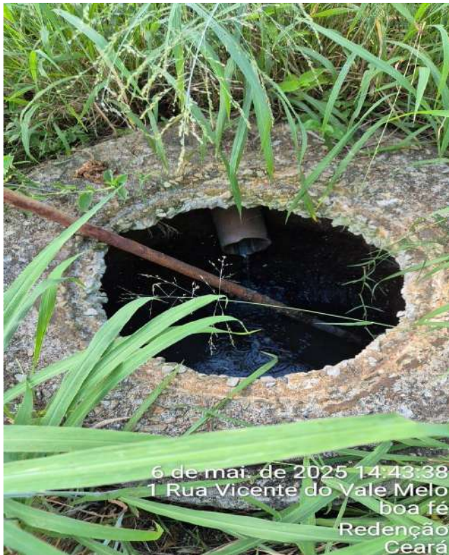
Foto 55 - ETE Redenção (Boa Fé): presença de vegetação e ausência de tampa.
