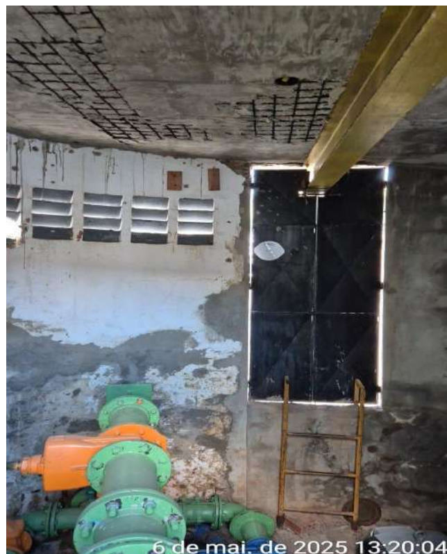
Foto 32 - EEAT-03: teto e paredes com rachaduras e pintura deteriorada.
