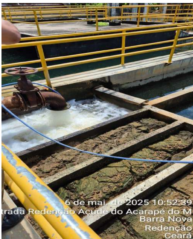
Foto 8 - ETA (floculador/decantador): acúmulo de sobrenadante.
