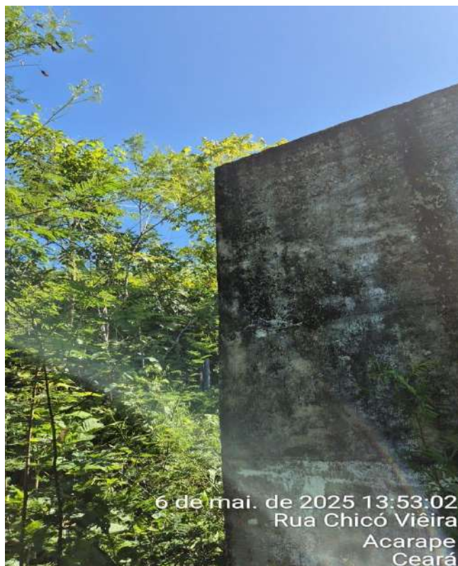
Foto 19 - RAP-07: pintura deteriorada.
