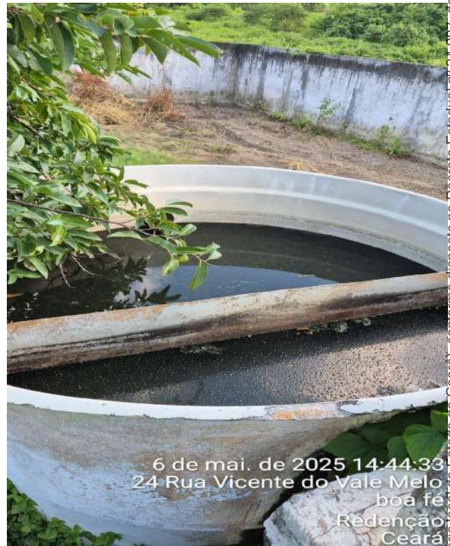
Foto 56 - ETE Redenção (Boa Fé): presença de vegetação e ausência de tampa.
