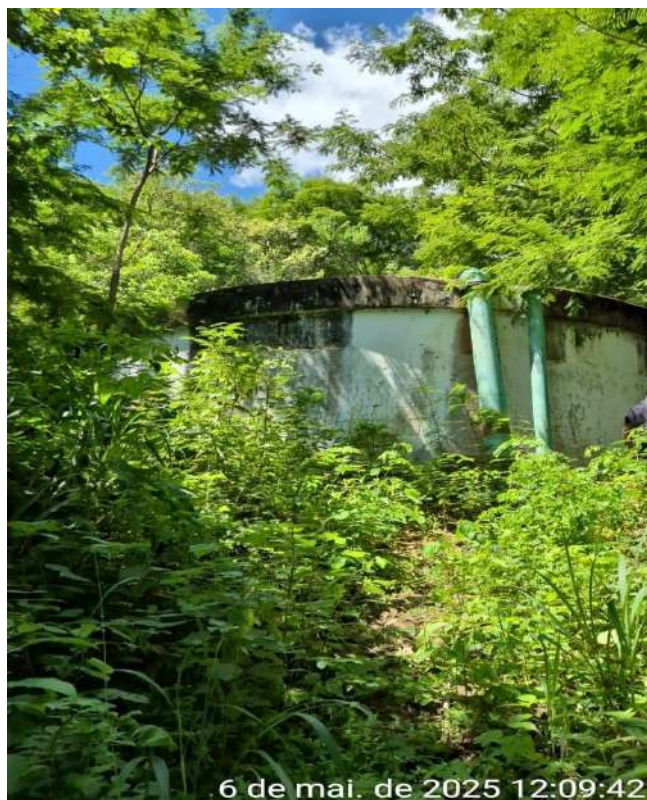
Foto 43 - RAP-02: pintura deteriorada e presença de vegetação, dificultando o acesso.
