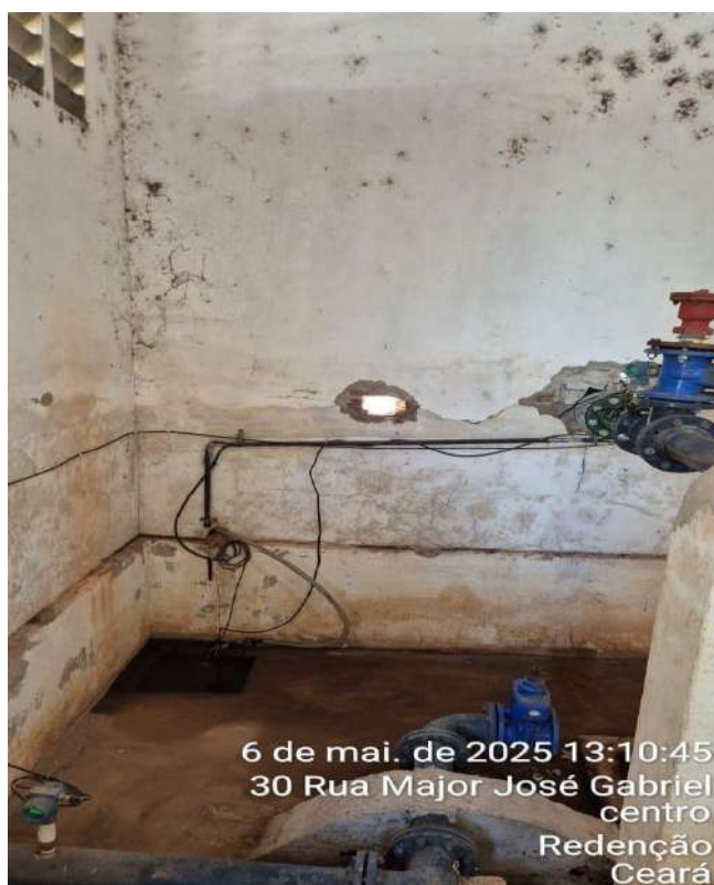
Foto 37 - Booster Santa Rita: fiação inadequada; perfuração na parede e pintura deteriorada.
