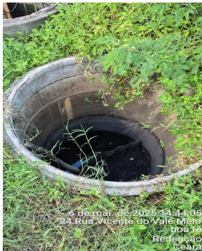
Foto 54 - ETE Redenção (Boa Fé): presença de vegetação e ausência de tampa.
