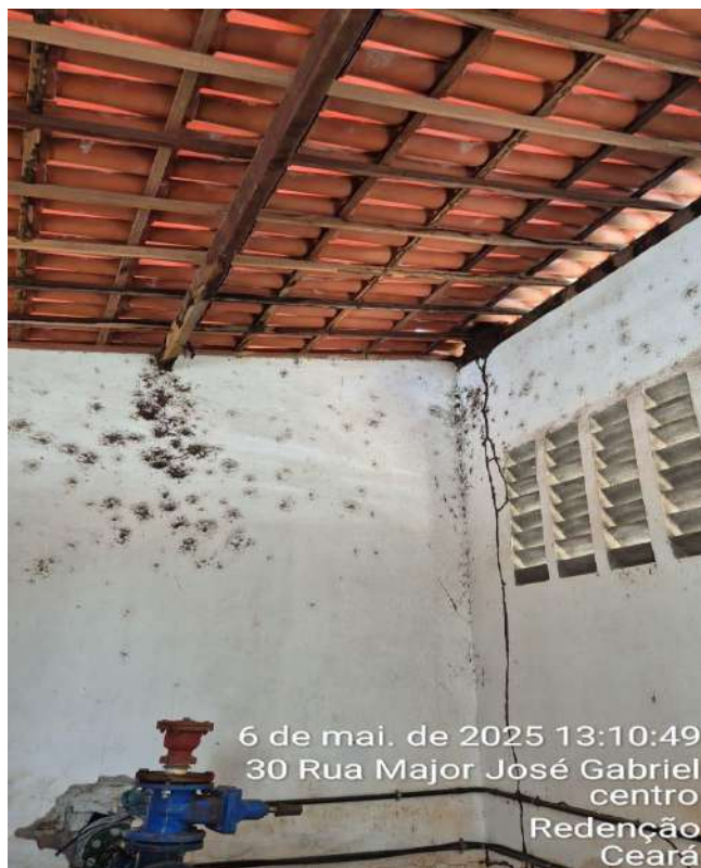
Foto 39 - Booster Santa Rita: presença de cupim e pintura deteriorada.
