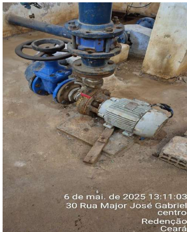
Foto 40 - Booster Santa Rita: base da bomba inadequada e ausência de bomba reserva.
