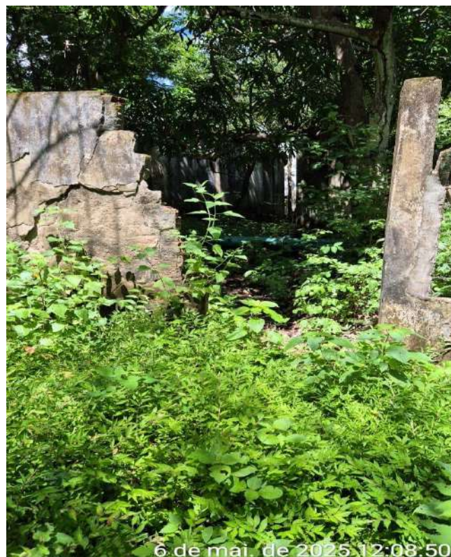
Foto 42 - RAP-02: presença de vegetação, dificultando o acesso.
