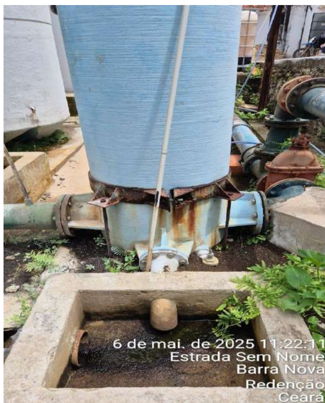
Foto 12 - ETA Redenção (torre de nível): estrutura oxidada.
