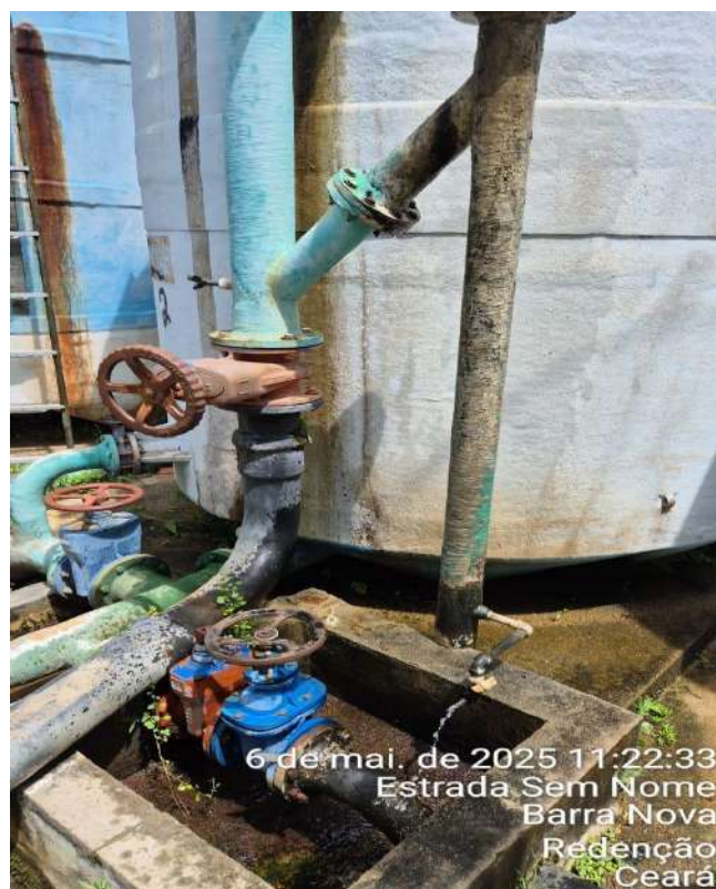
Foto 13 - ETA Redenção (filtros): pintura desgastada.
