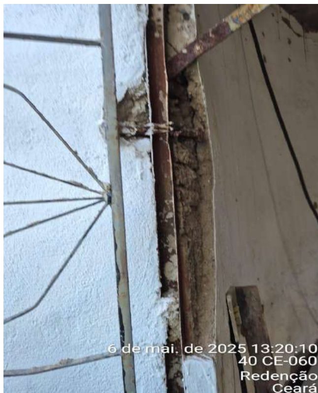
Foto 31 - EEAT-03: portão danificado.
