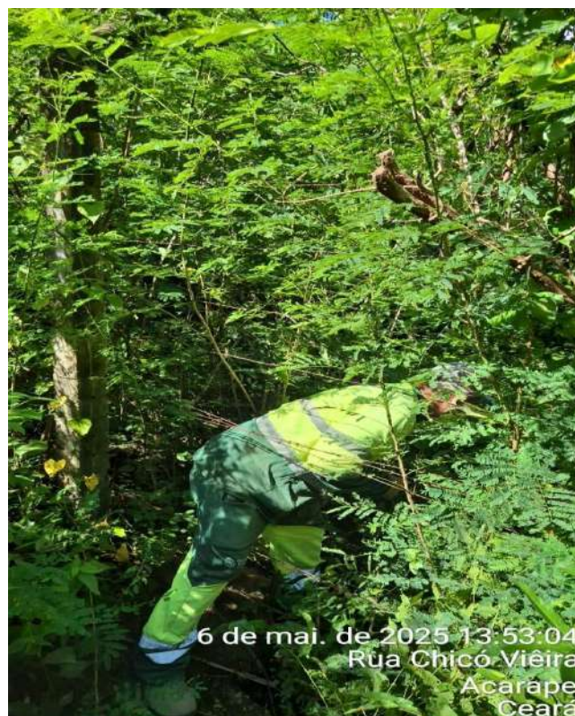
Foto 18 - RAP-07: presença de vegetação, dificultando o acesso.
