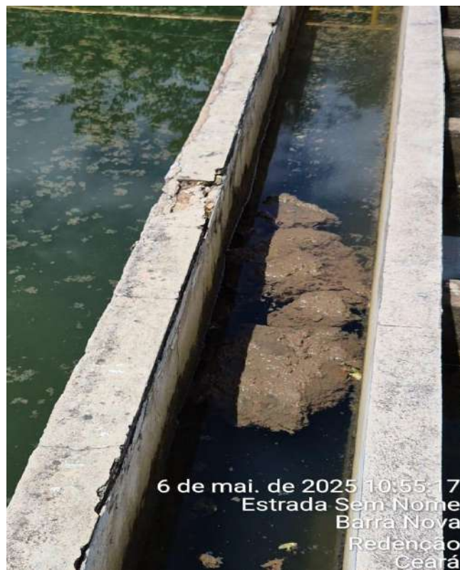
Foto 11 - ETA (floculadores/decantadores): calha danificada.
