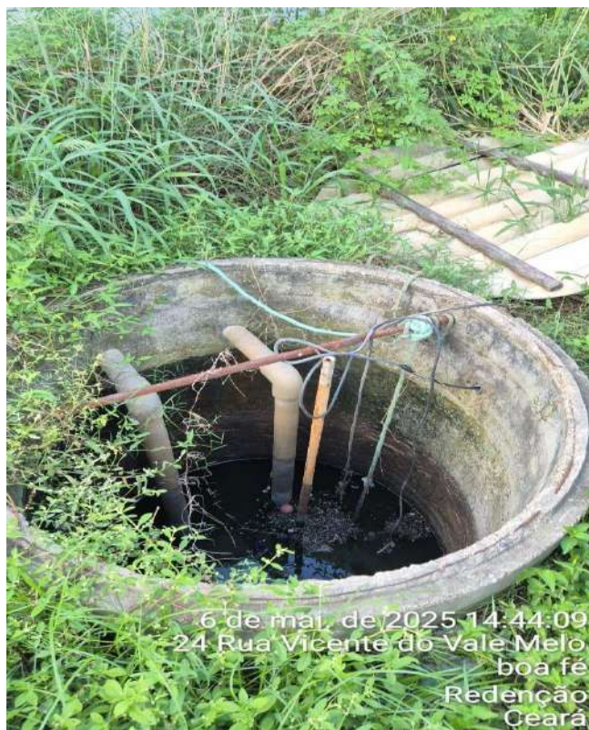
Foto 53 - ETE Redenção (Boa Fé): presença de vegetação e ausência de tampa.
