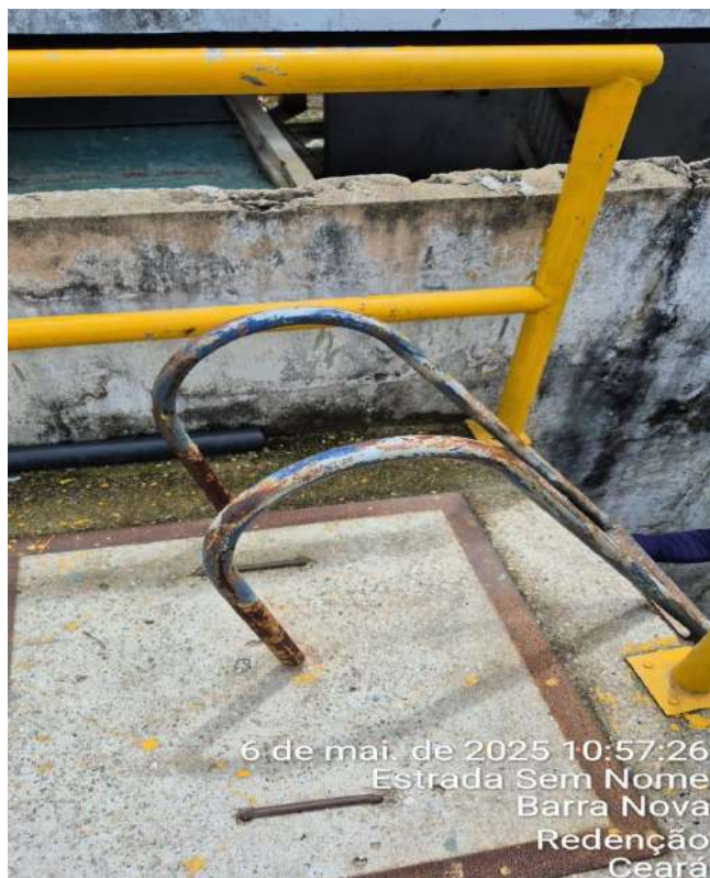
Foto 1 - ETA Redenção (floculadores/decantadores): escada de acesso inadequada, sem fixação.
