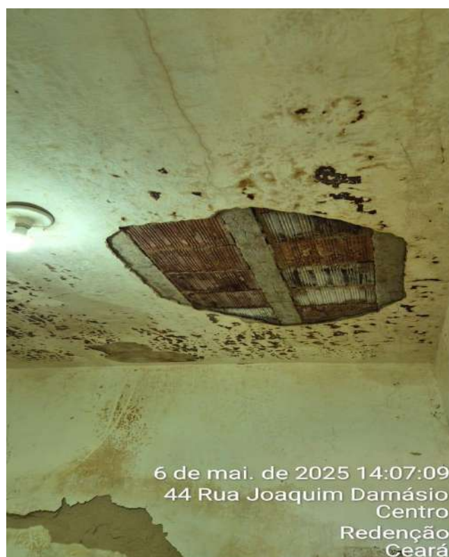
Foto 30 - EERD-02: teto com rachaduras e pintura deteriorada.
