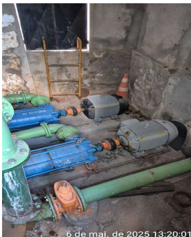
Foto 33 - EEAT-03: pintura deteriorada e acúmulo de sujeira.
