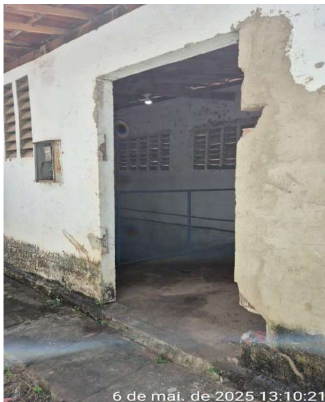
Foto 35 - Booster Santa Rita: portão da casa de comando danificado e pintura deteriorada.
