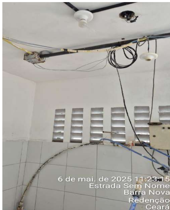
Foto 7 - ETA Redenção (casa de química): fiação inadequada.
