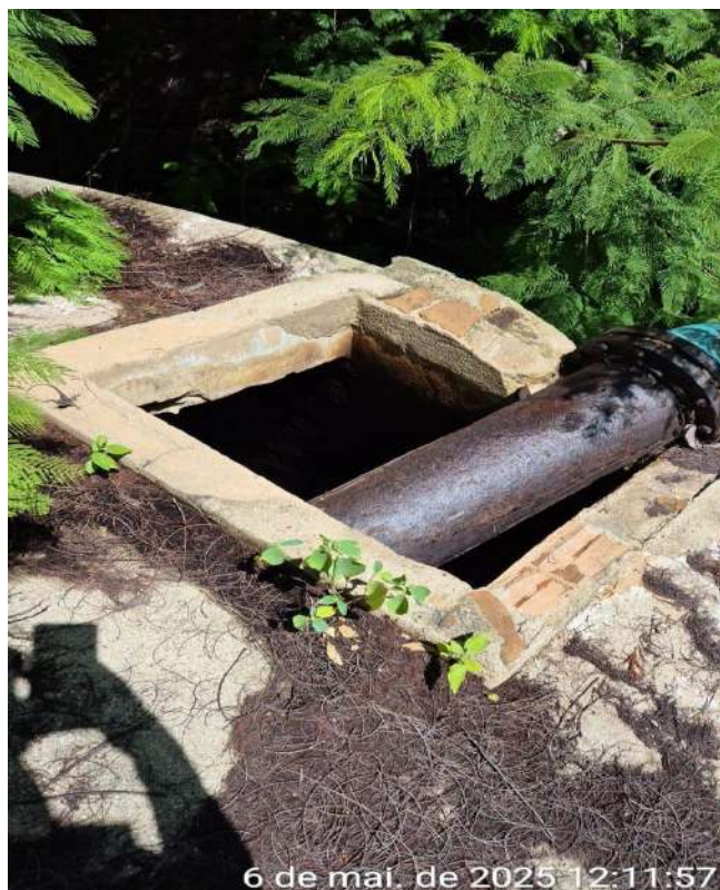
Foto 44 - RAP-02: ausência de fechamento hermético.
