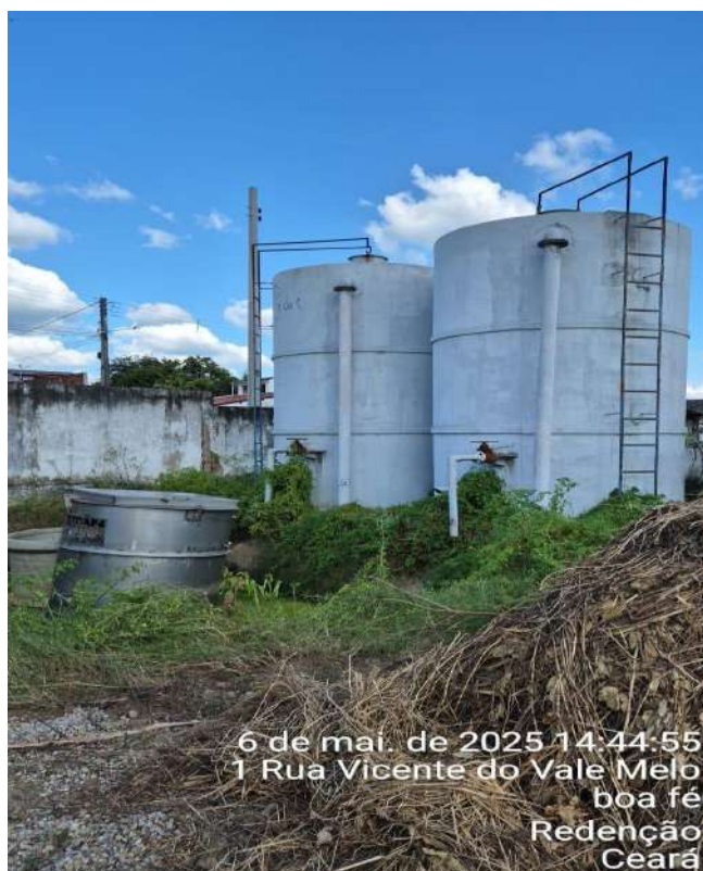
Foto 49 - ETE Redenção (Boa Fé): presença de vegetação.
