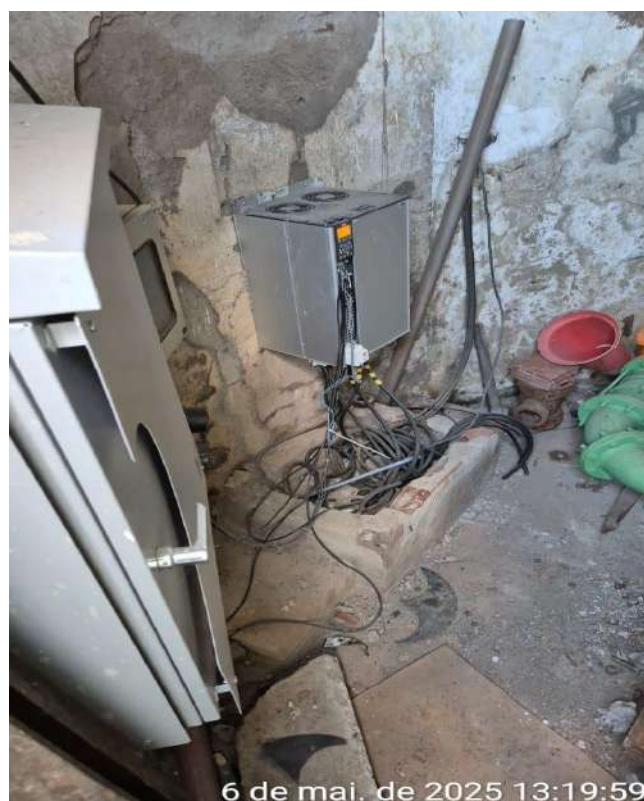
Foto 34 - EEAT-03: pintura deteriorada; acúmulo de sujeira e fiação inadequada.
