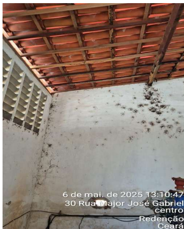
Foto 38 - Booster Santa Rita: fiação inadequada; perfuração na parede e pintura deteriorada.
