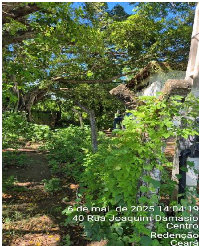
Foto 23 - EERD-02: cerca de proteção e isolamento danificada e vegetação no entorno.
