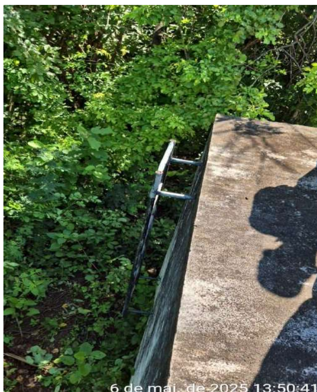
Foto 3 - RAP-07: ausência de corrimão na escada de acesso à laje.
