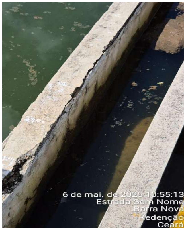
Foto 10- ETA (floculadores/decantadores): calha danificada.
