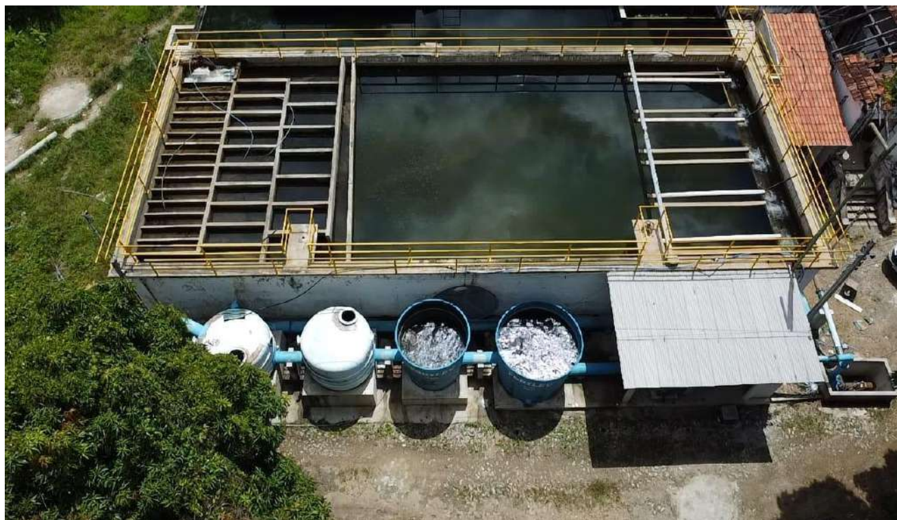
Foto 16 - ETA Redenção: tampas ausentes nos pontos de aplicação dos químicos.
