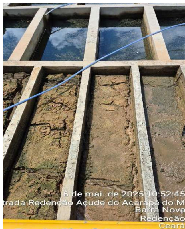
Foto 9 - ETA Redenção (floculador): acúmulo de sobrenadante.
