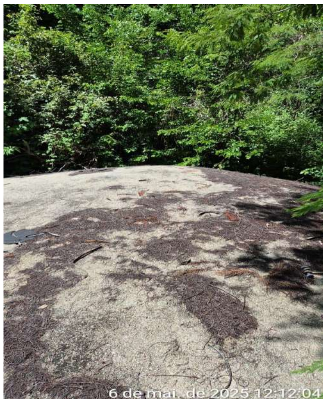
Foto 46 - RAP-02: acúmulo de sujeira sobre a laje.
