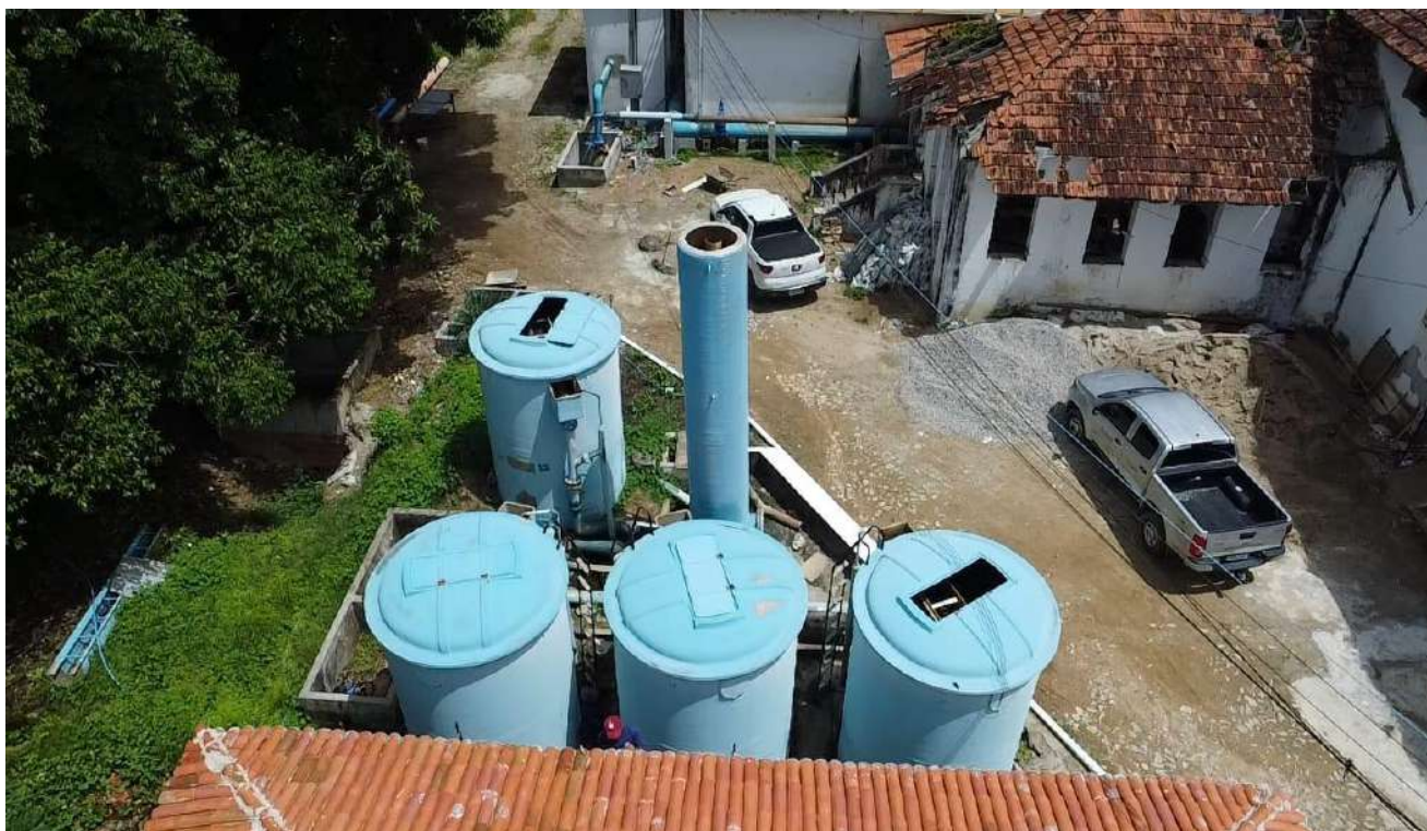
Foto 15 - ETA Redenção (filtros): tampas ausentes.
