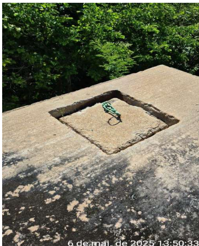
Foto 21 - RAP-07: tampa danificada.
