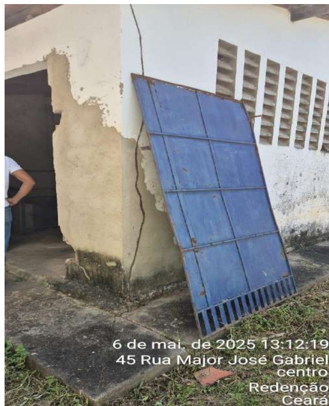
Foto 36 - Booster Santa Rita: portão danificado; presença de cupim.
