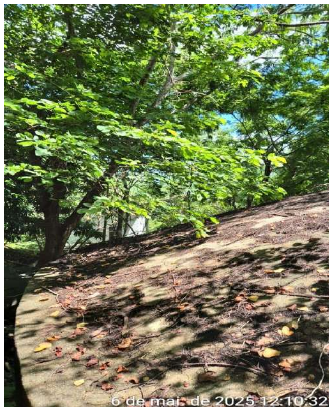
Foto 47 - RAP-02: acúmulo de sujeira sobre a laje.
