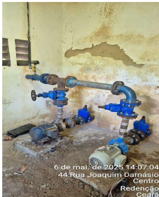
Foto 28 - EERD-02: base das bombas danificadas e parede com rachaduras.
