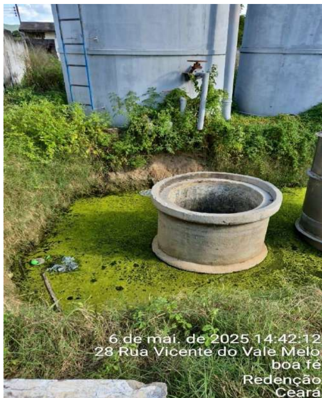
Foto 51 - ETE Redenção (Boa Fé): extravasamento de esgoto e acúmulo de lodo.
