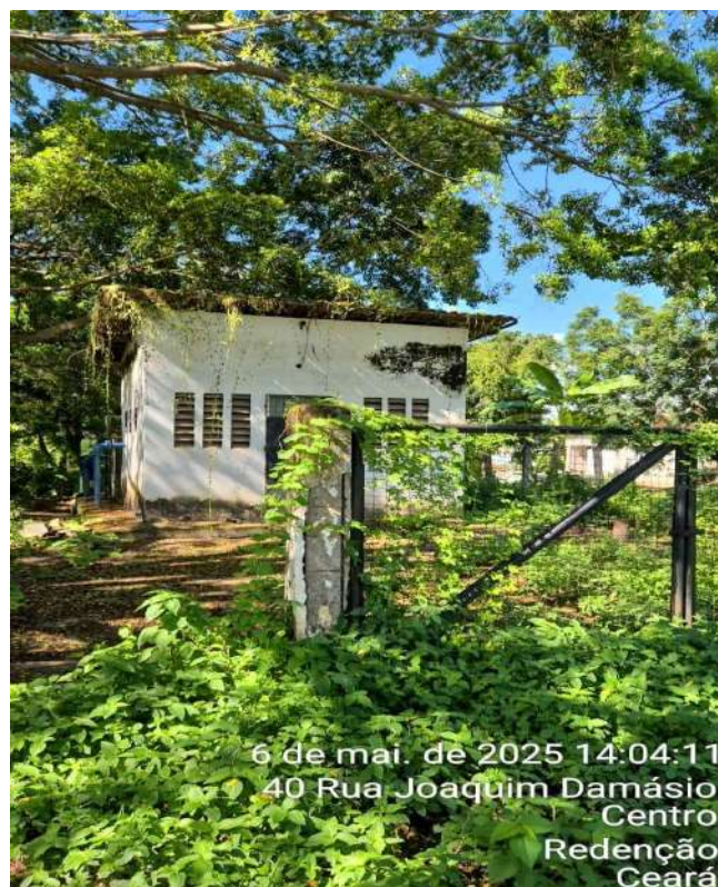
Foto 22 - EERD-02: rachaduras no pilar do portão de acesso e vegetação no entorno.
