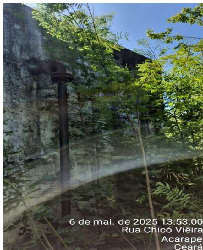
Foto 20 - RAP-07: pintura deteriorada.
