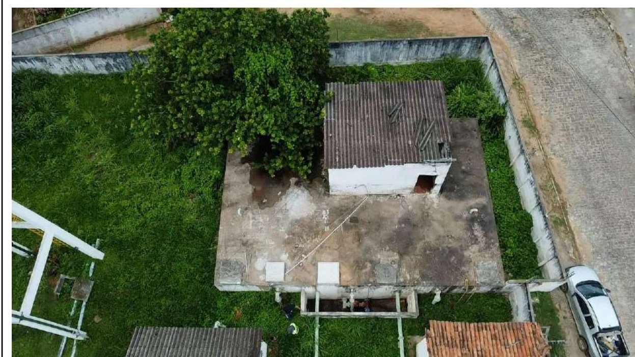
Foto 71 - RSE-02: telhado quebrado, acúmulo de água devido a vegetação superior.
