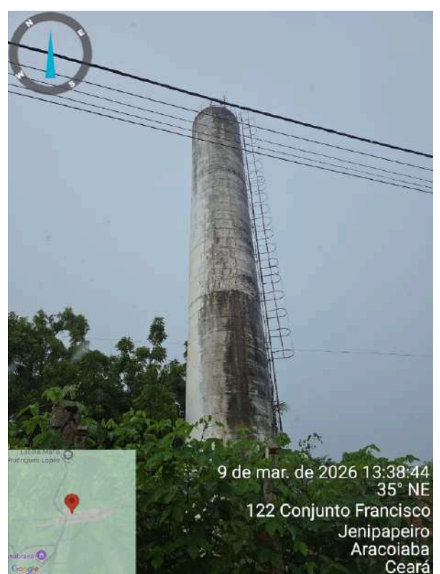
Foto 28 - REL-07: reservatório inclinado, risco de colapso da estrutura, desativado sem desmobilização da estrutura, em avançado estado de deterioração.
