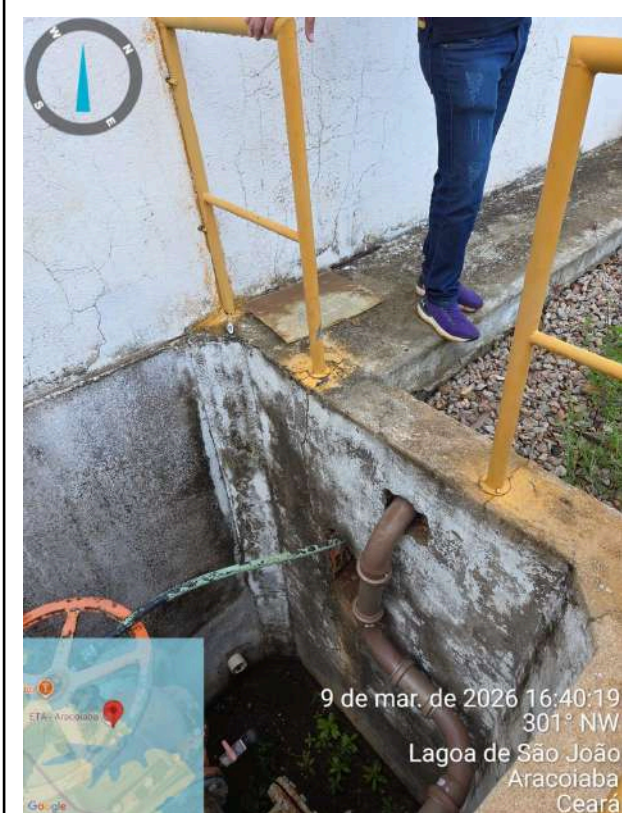
Foto 43 - ETA: caixa da bomba sem escada de acesso.
