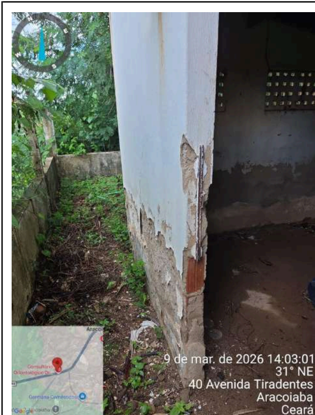
Foto 17 - EERD-04: parede com armadura exposta e sem porta, revestimento deteriorado.
