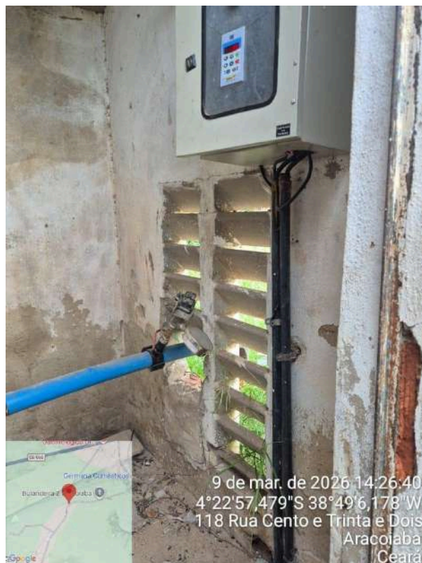
Foto 4 - EERD-01: abertura inadequada para tubulação na parede, patologias no umbral da porta, cobogó apresentando deterioração e sujeira.
