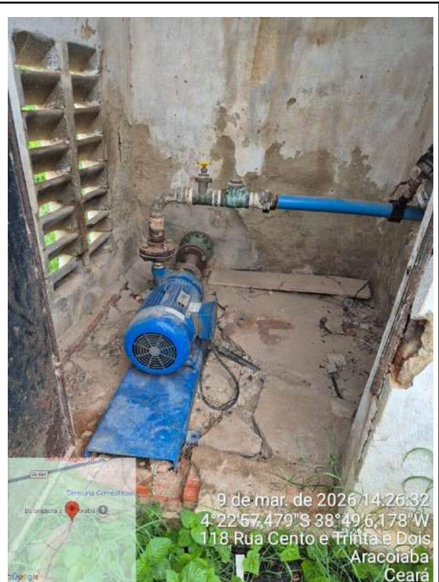
Foto 6 - EERD-01: piso da casa de controle quebrado, com parte das conexões oxidadas.
