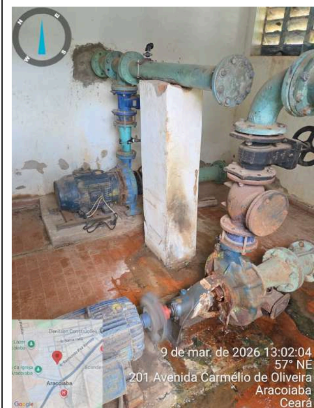
Foto 55 - Núcleo antigo / casa de bombas: paredes desgastadas e válvulas oxidadas.
