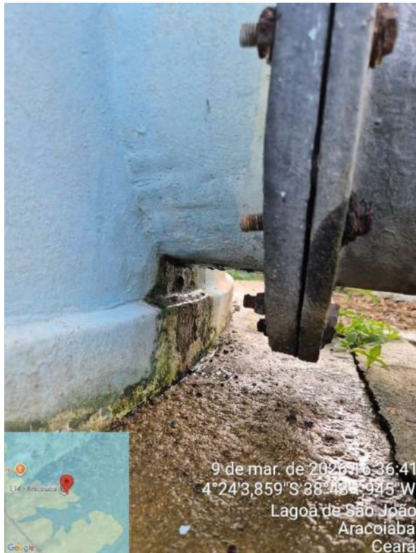
Foto 37 - ETA: F-01 com vazamento no filtro.
