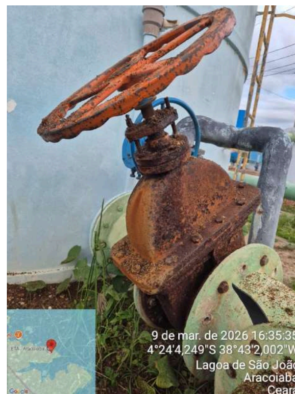
Foto 39 - ETA: F-02 com válvula com oxidação grave.
