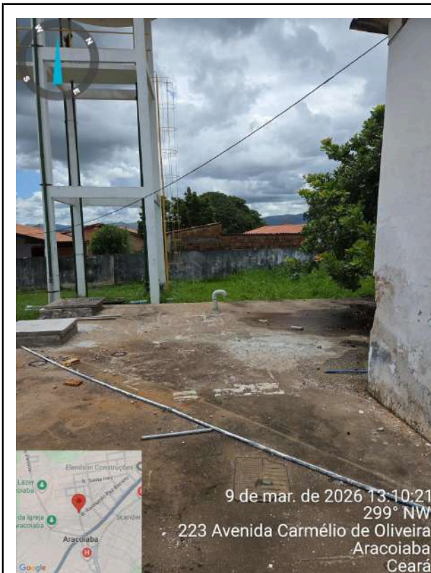
Foto 69 - RSE-02: acúmulo de sujeiras na parte superior do reservatório.
