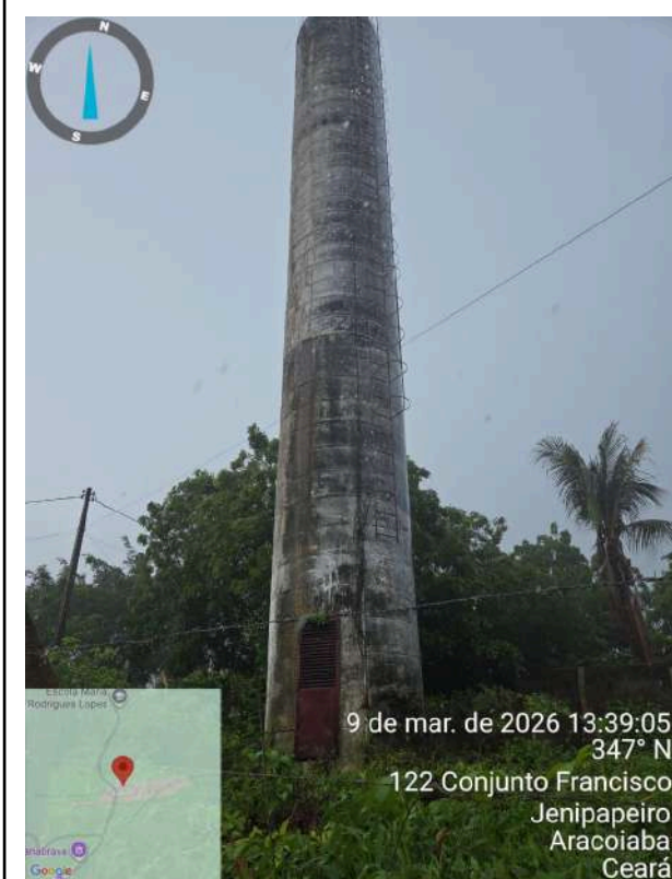
Foto 27 - REL-07: reservatório inclinado, risco de colapso da estrutura, desativado sem desmobilização da estrutura, em avançado estado de deterioração.
