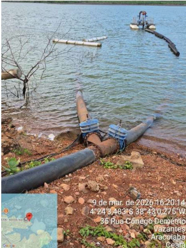
Foto 1 - Captação: tubulação oxidada.
