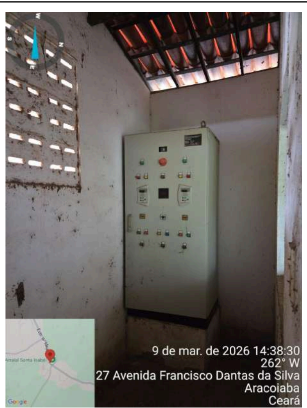
Foto 26 - EEAT-09 Jaguarão: cobogós com acúmulo de sujidades.
