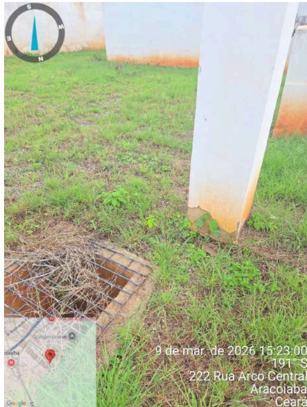
Foto 30 - REL-10: pilar de base desgastado.
