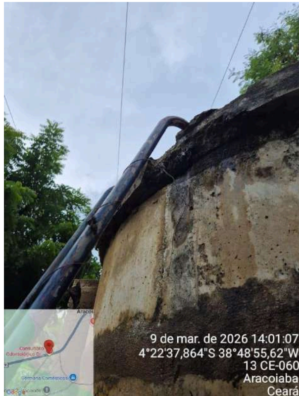
Foto 22 - RAP-06: escada com um apoio solto e sinais de oxidação.
