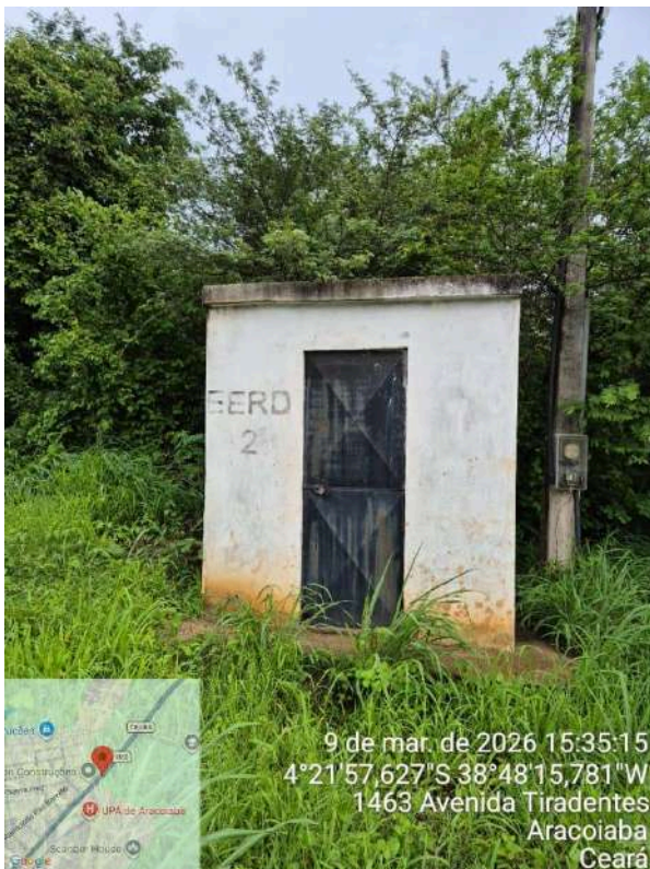
Foto 11 - EERD-02: vegetação elevada, pintura deteriorada, indícios de corrosão na porta metálica, identificação deteriorada.
