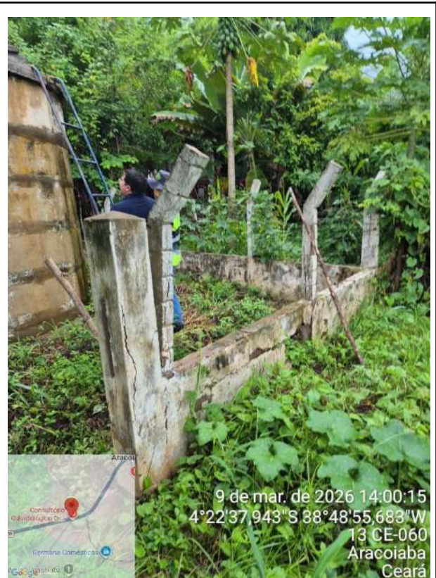
Foto 18 - RAP-06: vegetação elevada, muro quebrado, com revestimento deteriorado, fechamento prejudicado.
