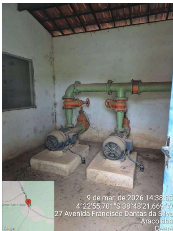
Foto 24 - EEAT-09 Jaguarão: bombas com camada de poeira; parede e piso com sujeidades.
