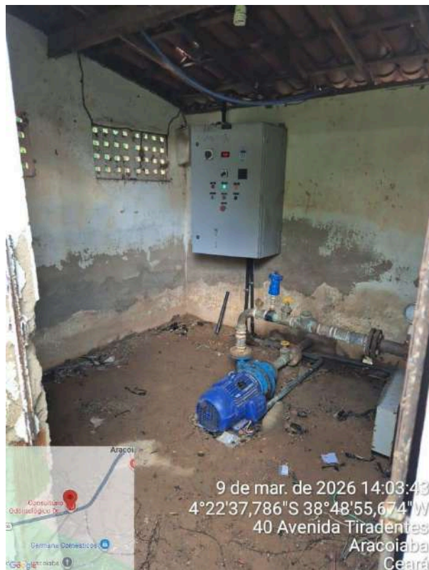
Foto 16 - EERD-04: parede interna desgastada e casa de comando sem piso adequado.
