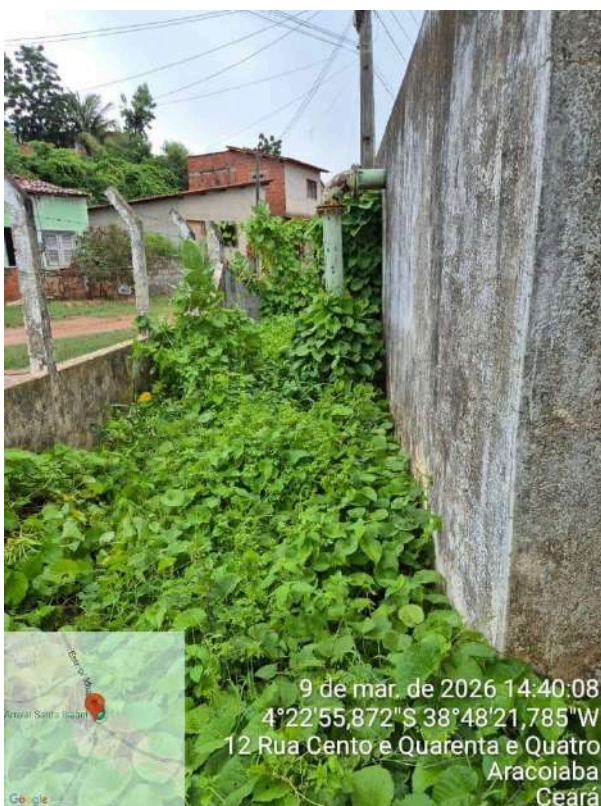
Foto 23 - EEAT-09 Jaguarão: vegetação elevada.
