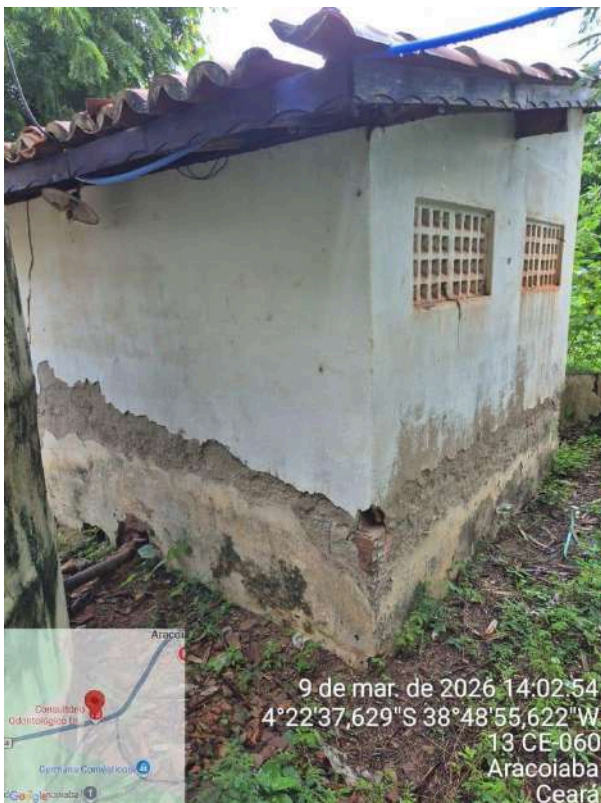
Foto 15 - EERD-04: parede com estrutura deteriorada.
