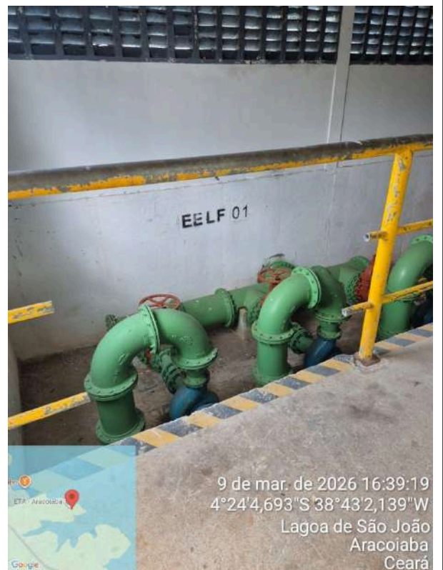
Foto 48 - ETA: casa de bombas com corrimão danificado.
