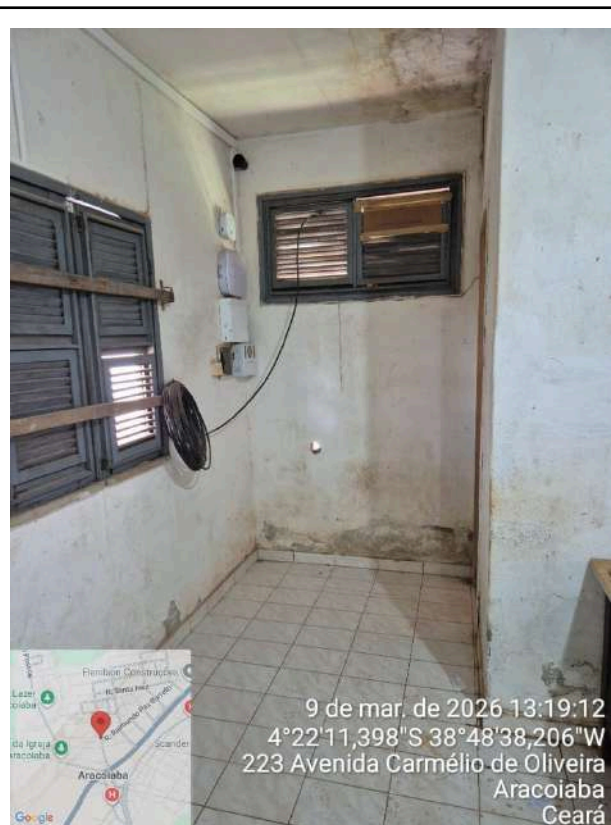
Foto 62 - Núcleo antigo: paredes desgastadas.
