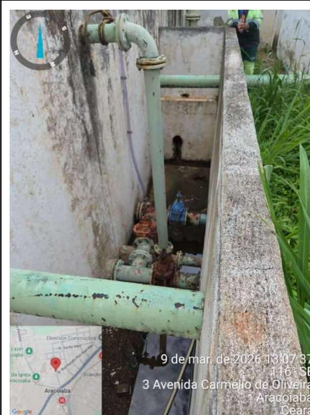
Foto 68 - RSE-02: válvulas e parte da tubulação oxidadas.
