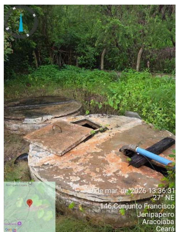
Foto 36 - Poço: tampa de proteção do poço desgastada, com madeira de apoio da tubulação.
