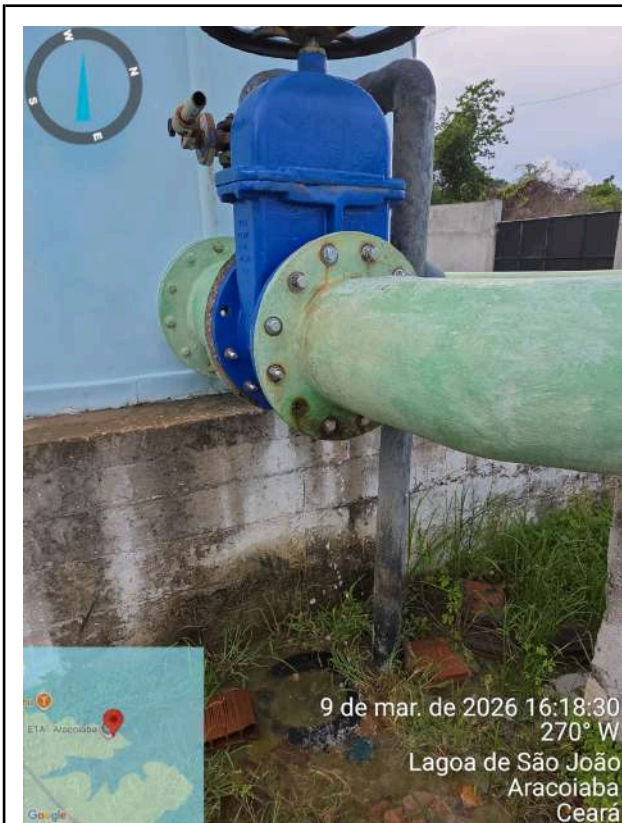
Foto 41 - ETA: F-03 com vazamento na tubulação.
