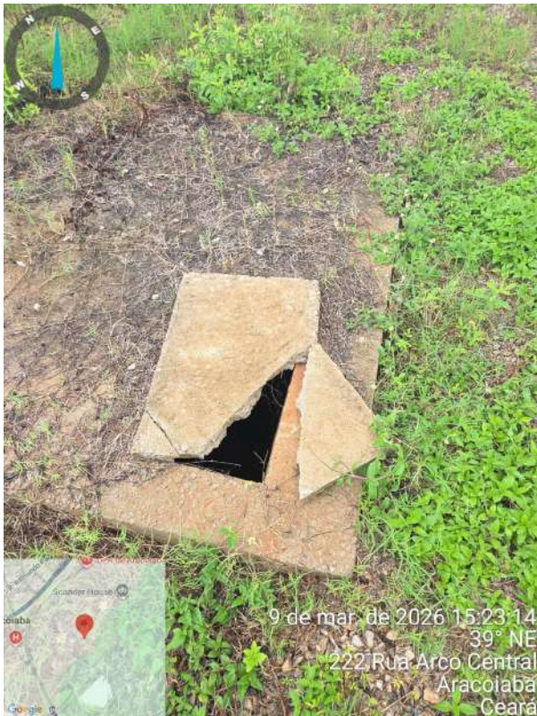
Foto 29 - REL-10: tampa quebrada.
