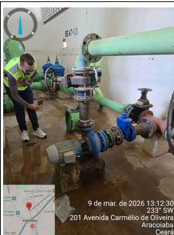
Foto 66 - EEAT-03: bomba com vazamento.
