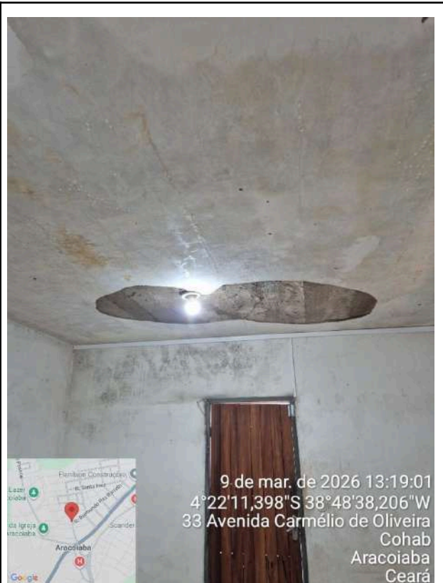
Foto 58 - Núcleo antigo: almoxarifado antigo com infiltração no teto.
