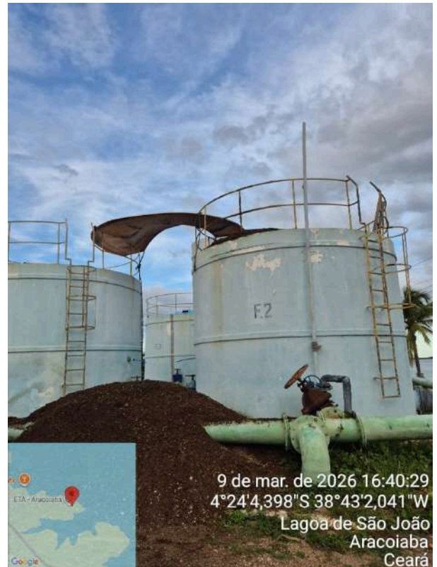
Foto 38 - ETA: F-02 com tampa deslocada e acúmulo de material de obra na tubulação.
