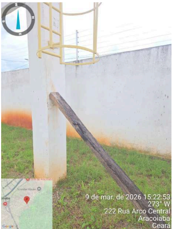
Foto 31 - REL-10: acesso à escada realizado de forma improvisada, com uso de peça de madeira como apoio/degrau.
