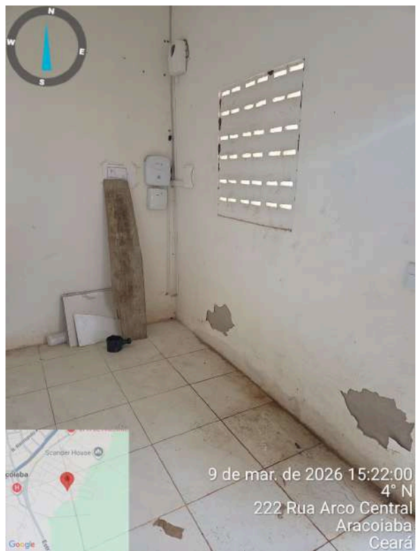
Foto 32 - EEAT-08: casa de comando com sujeira e desgaste no revestimento.
