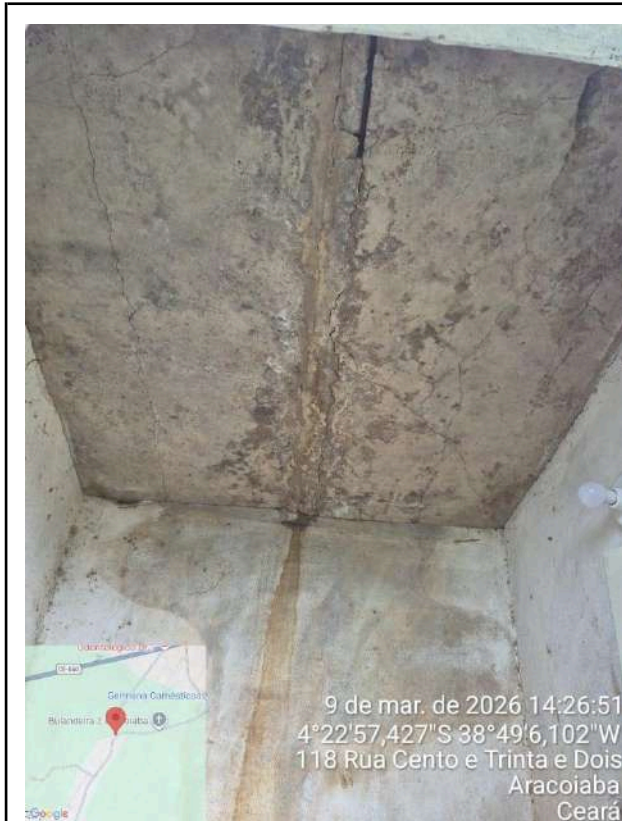
Foto 5 - EERD-01: teto com rachaduras e armadura exposta.
