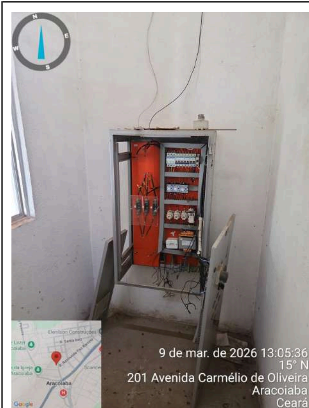
Foto 57 - Núcleo antigo / casa de bombas: quadro de comando avariado e sem uso.
