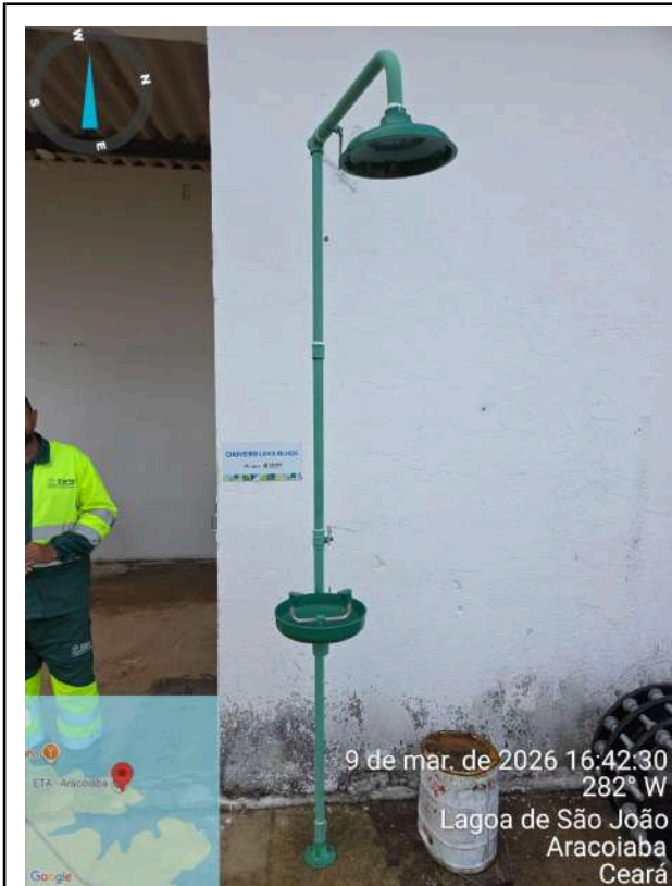
Foto 45 - ETA: chuveiro de emergência operante.
