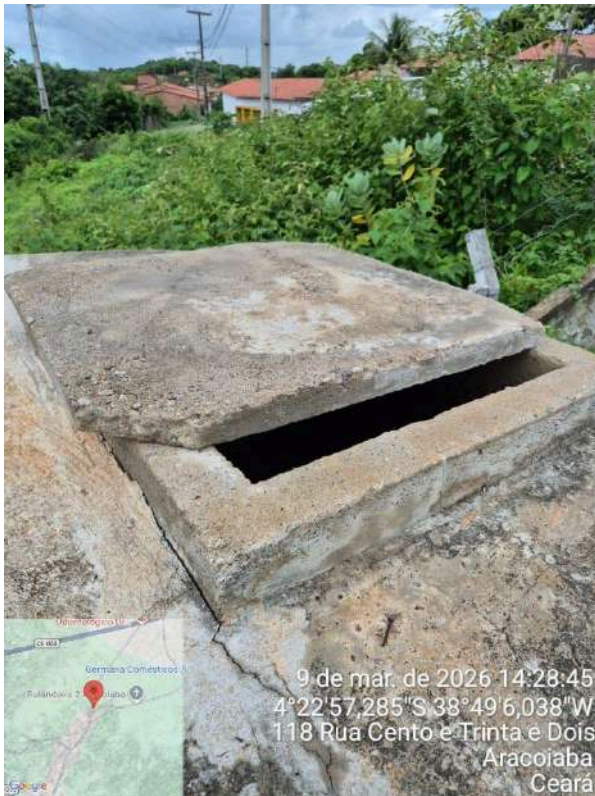
Foto 9 - RAP-05: tampa deslocada.
