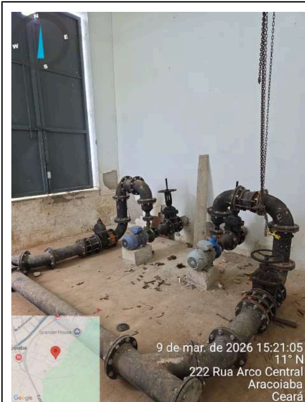
Foto 33 - EEAT-08: parede descascando, piso com sujeira, tubulação das bombas desgastada.
