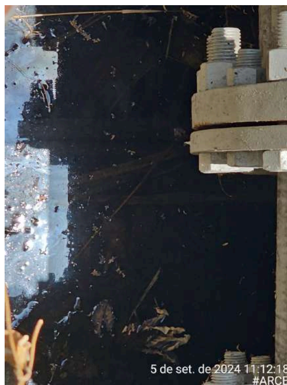
Foto 14 - Reservatório Ancuri: Caixa da adutora com acúmulo de água.
