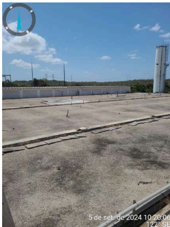
Foto 7 - RSE-01: Tubulação de respiro inadequada.
