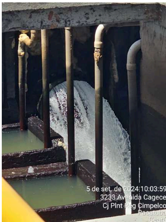
Foto 3 - Filtros: Filtros 1 e 2 com válvulas de registro sem fechar completamente, acarretando perda de água com produtos químicos já adicionados, nos momentos das lavagens.
