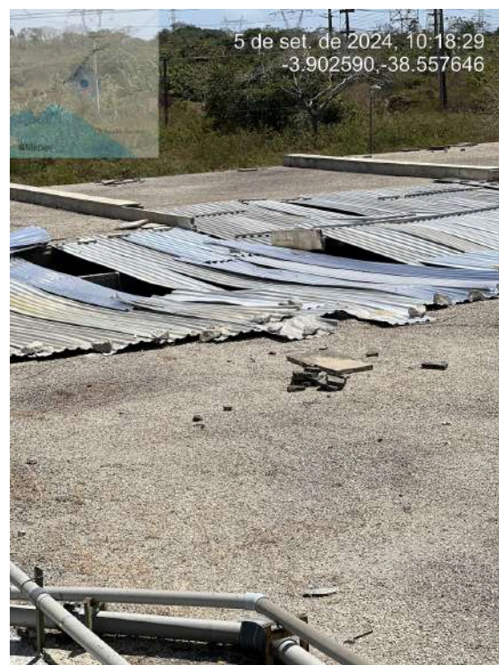
Foto 6 - RSE-01: Parte da laje danificada, com telhas improvisadas, sujeitando a água tratada a intempéries e riscos aos operadores
