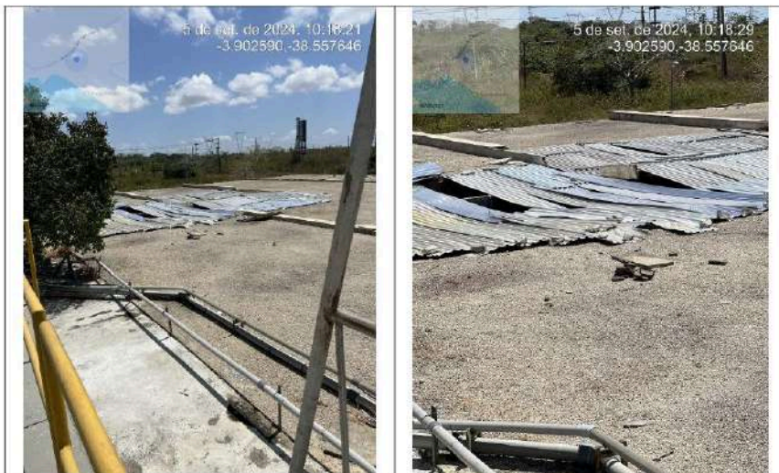
Fotos 1 e 2 – Vista do reservatório de contato da ETA Gavião, com destaque para a cobertura caída.
