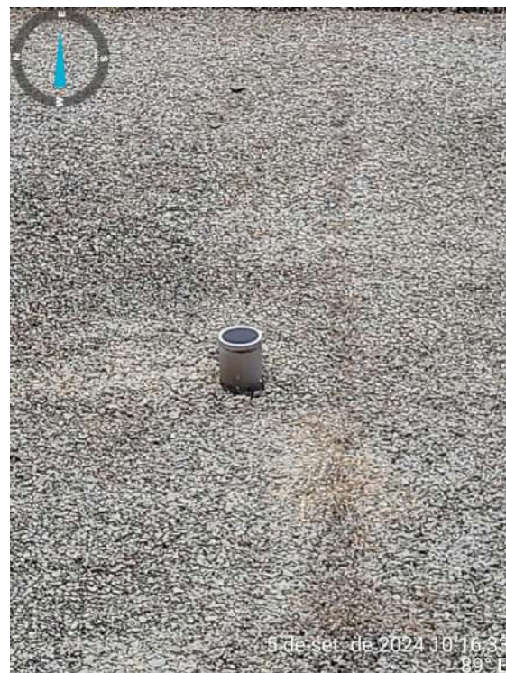
Foto 8 - RSE-01: Tubulação de respiro inadequada.
