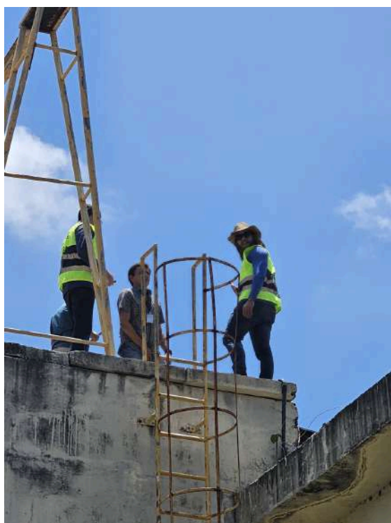
Foto 17 - Reservatório Ancuri: Escada em processo de oxidação.
