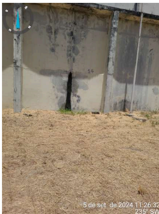
Foto 13 - Reservatório Ancuri: Vazamento nas paredes do reservatório.
