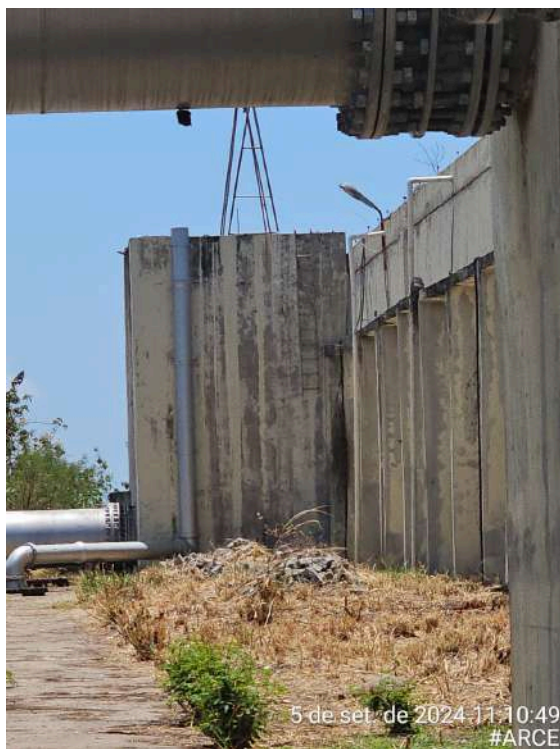
Foto 15 - Reservatório Ancuri: Escada sem acessibilidade.
