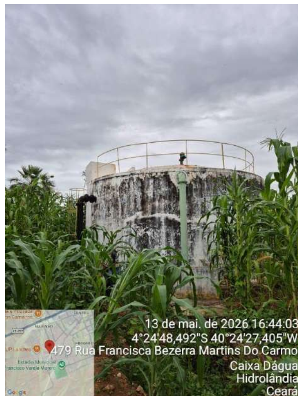
Foto 17 - RAP-04 (Sede): pintura desgastada.
