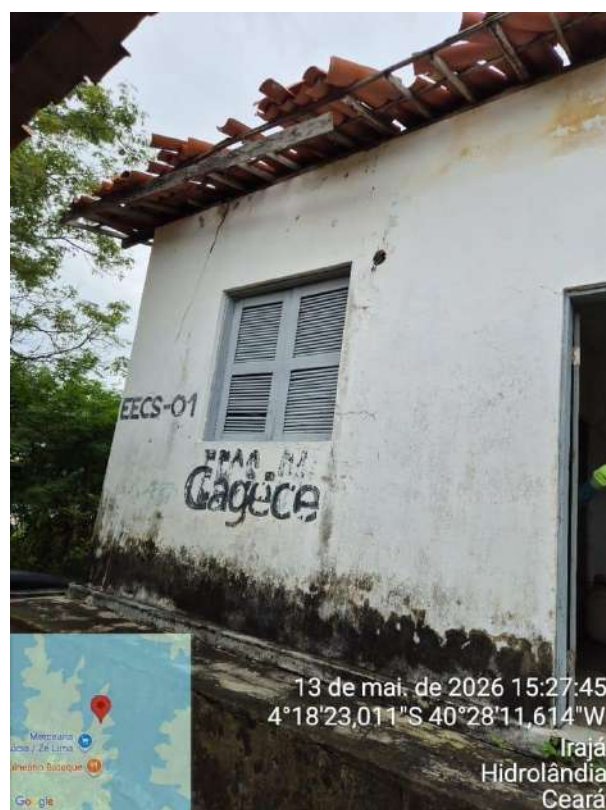
Foto 27 - EECS-01 (Irajá): pintura desgastada; telhado danificado.
