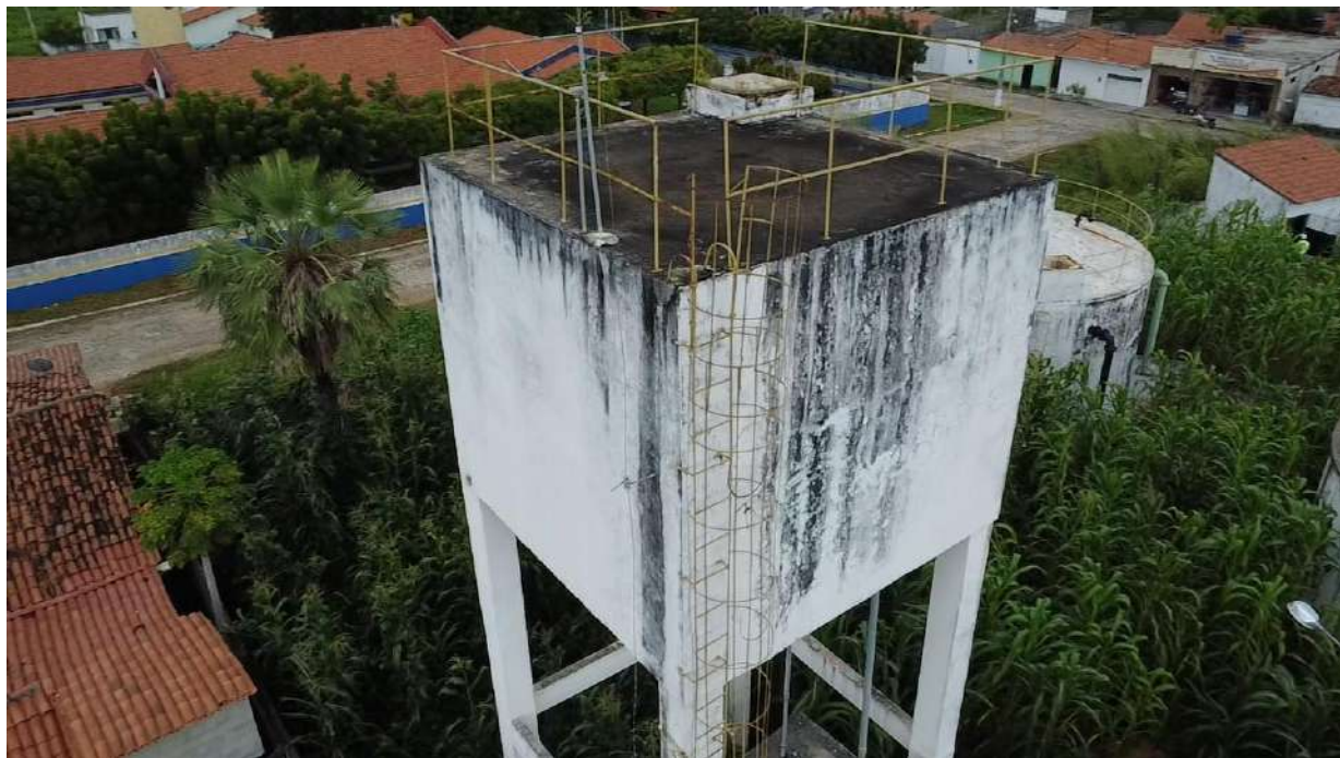
Foto 21 - REL-01 (Sede): pintura desgastada, escada de acesso a tampa sem guarda-corpo.
