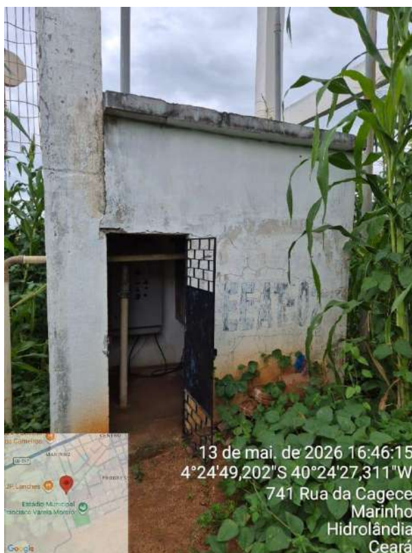
Foto 14 - EEAT-02 (Sede): paredes externas com pintura desgastada e rachaduras.
