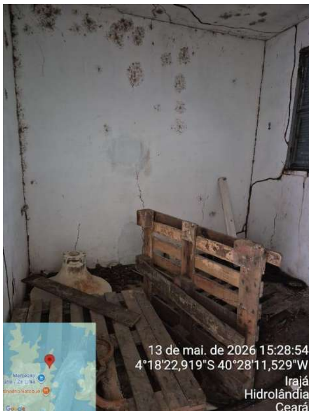
Foto 28 - EECS-01 (Irajá): pintura desgastada; presença de cupim, sujeira e entulho.
