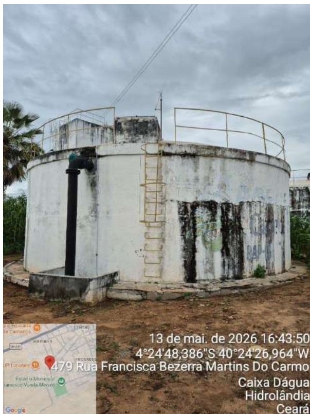
Foto 16 - RAP-03 (Sede): pintura desgastada.
