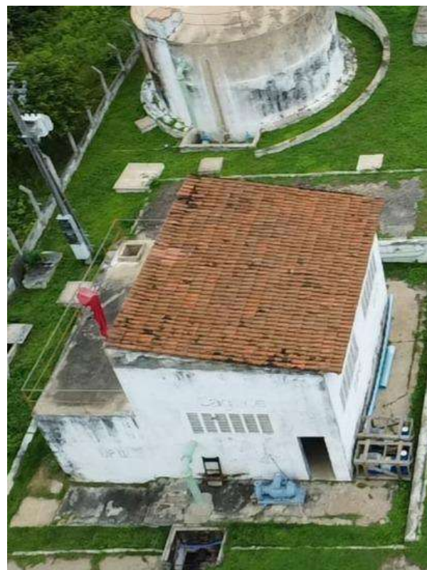
Foto 4 - RAP-02 (Irajá): sem tampa.
