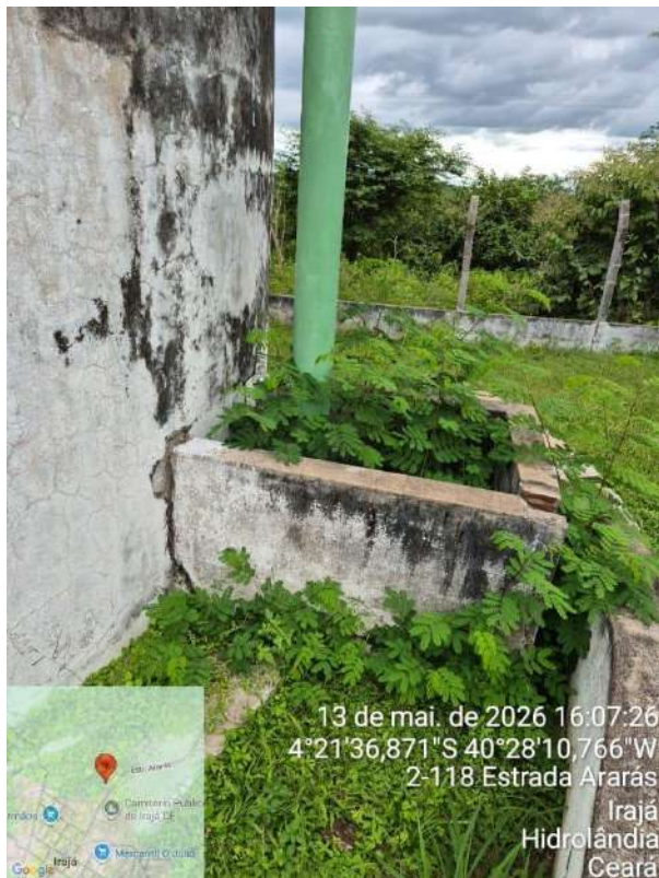
Foto 35 - RAP-01 (Irajá): vegetação crescida na caixa.
