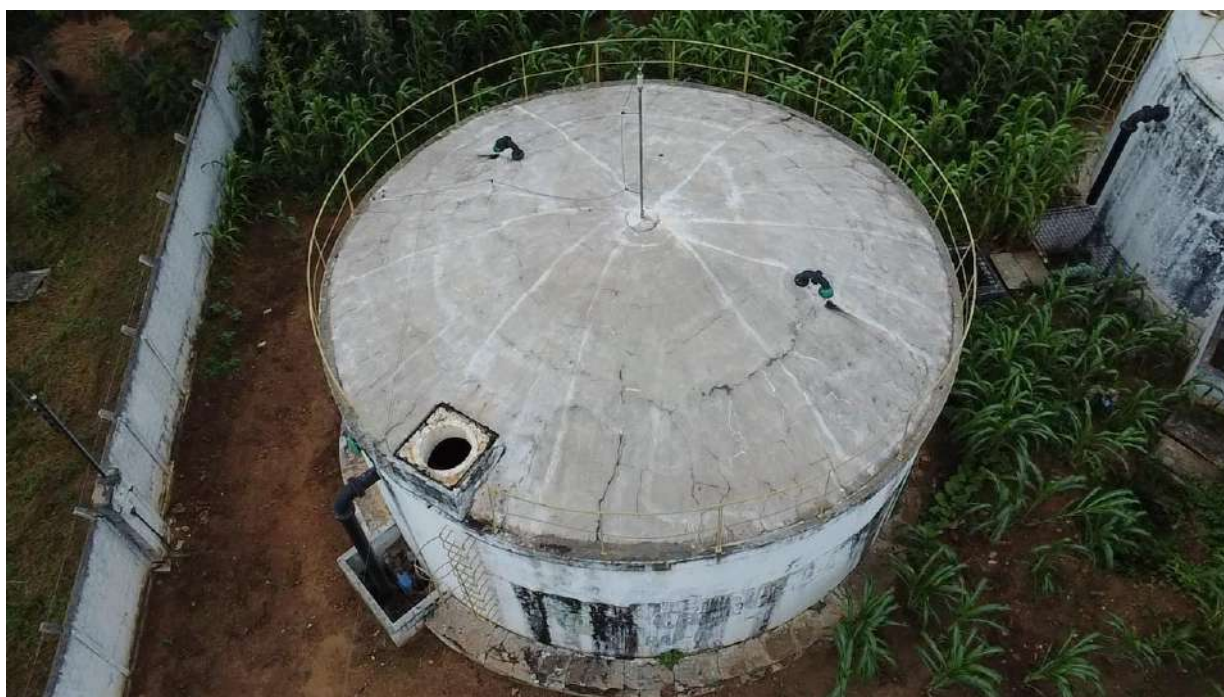
Foto 18 - RAP-03 (Sede): pintura desgastada; rachaduras na laje; tubulação de respiro oxidada.
