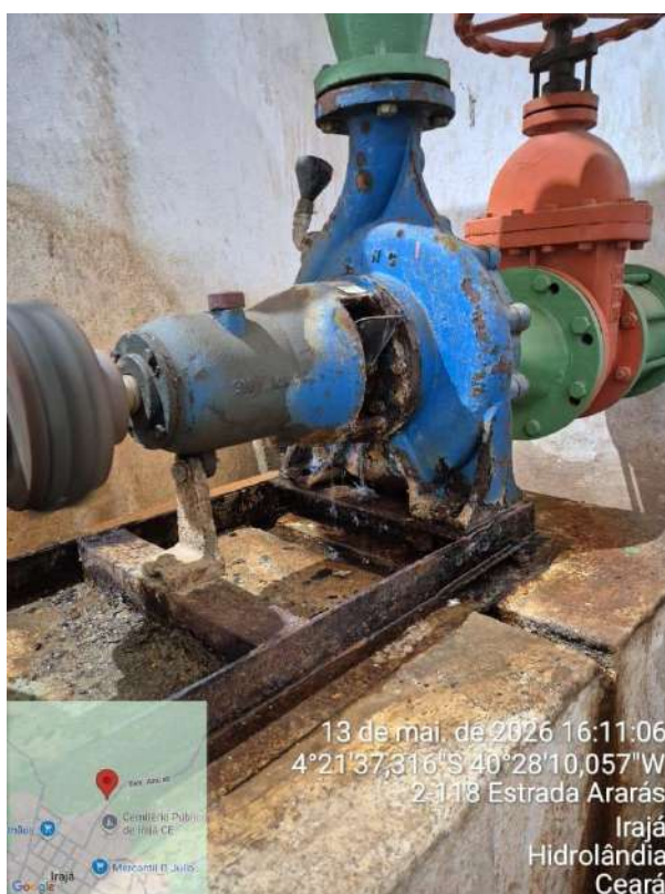
Foto 45 - ETA Irajá / Casa de Bombas: bomba da EEAT-01 oxidada, com vazamento e sem caixa de proteção.
