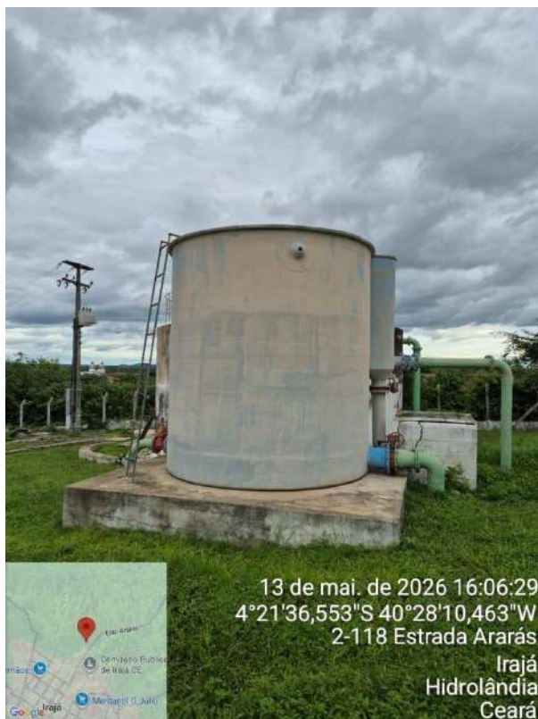
Foto 39 - ETA (Irajá): filtro F-04 com pintura desgastada.
