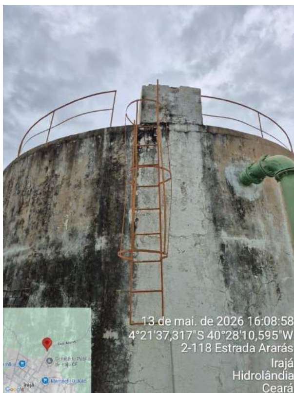
Foto 33 - RAP-01 (Irajá): pintura desgastada; escada danificada; rachaduras na laje.
