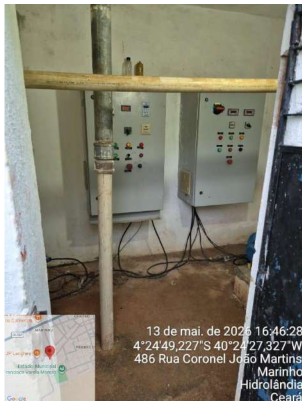
Foto 3 - EEAT-02 (Sede): fiação sem eletrodutos.
