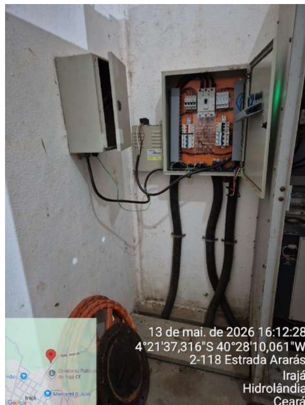
Foto 44 - ETA (Irajá / Casa de Bombas: fiação na caixa impedindo fechamento.
