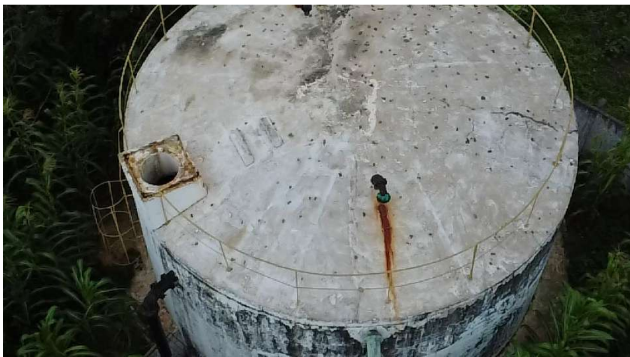
Foto 2 - RAP-04 (Sede): sem tampa.
