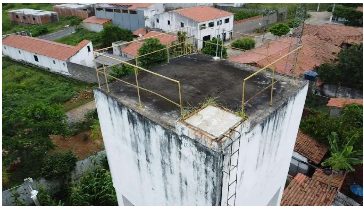
Foto 20 - REL-01 (Sede): pintura desgastada, sem tampa, escada de acesso a tampa sem guarda-corpo.
