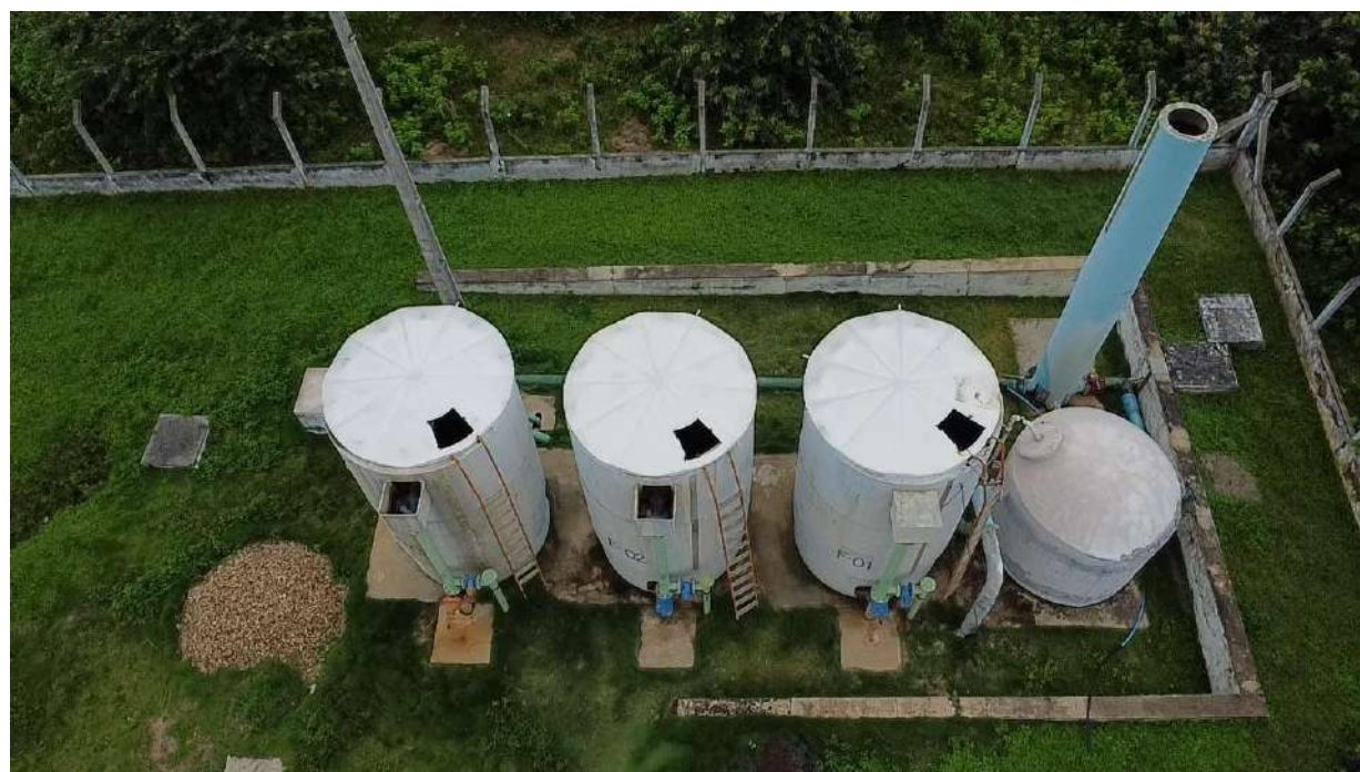
Foto 5 - ETA (Irajá): filtros F-01, F-02 e F-03 sem tampa.
