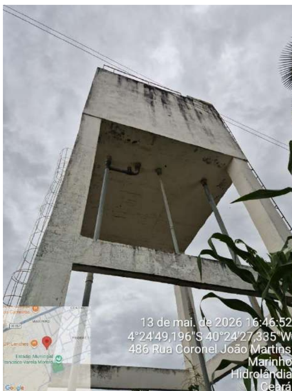
Foto 22 - REL-01 (Sede): pintura desgastada.
