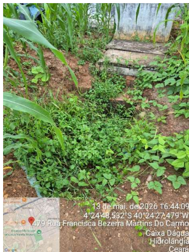
Foto 15 - EEAT-02 (Sede): registro sem caixa e grade de proteção, coberto por vegetação.
