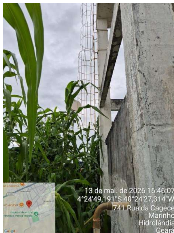
Foto 23 - REL-01 (Sede): pintura desgastada.
