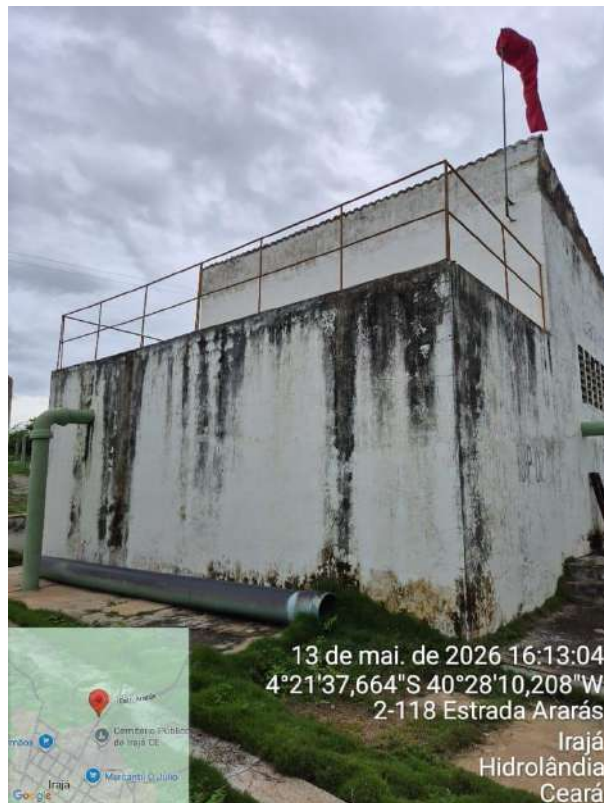
Foto 36 - RAP-02 (Irajá): pintura desgastada, com indícios de infiltração.
