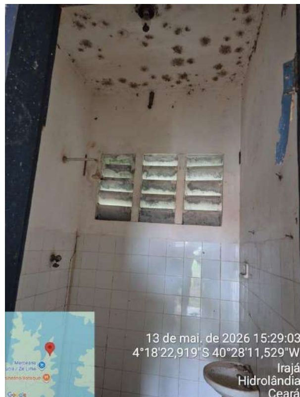
Foto 29 - EECS-01 (Irajá): pintura desgastada; presença de cupim, sujeira e entulho.
