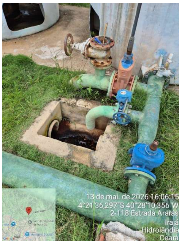
Foto 41 - ETA (Irajá): caixa sem grade de proteção ou contenção elevada.
