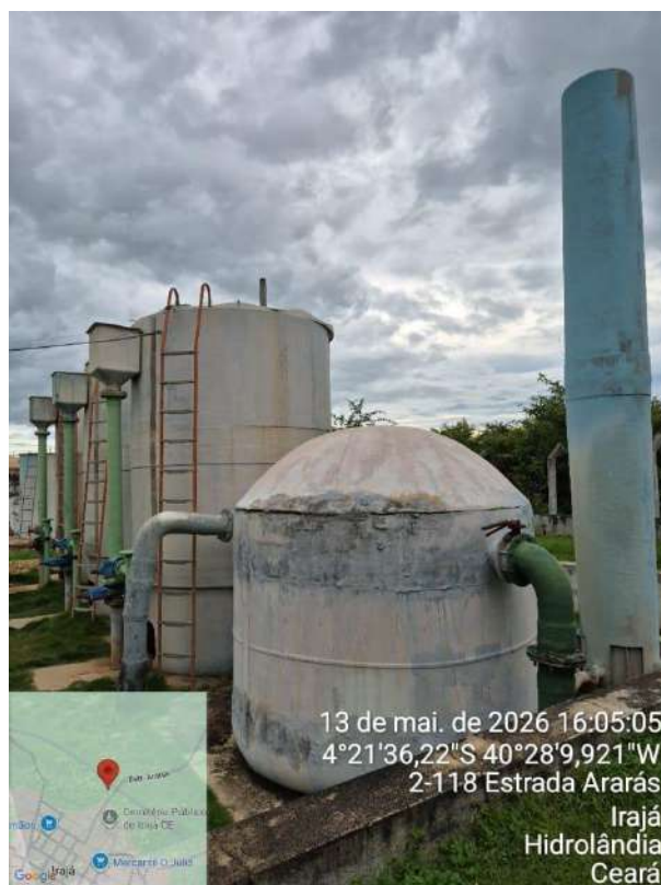
Foto 38 - ETA (Irajá): filtros F-01 a F-03 com pintura desgastada.
