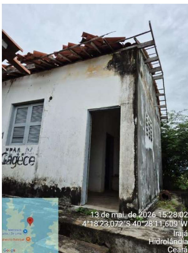
Foto 26 - EECS-01 (Irajá): pintura desgastada; telhado danificado.
