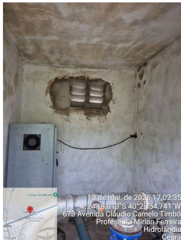
Foto 9 - EEAT-03 (Sede): paredes desgastadas, sem iluminação interna.
