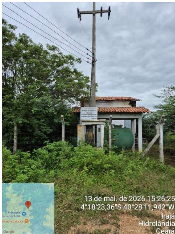
Foto 24 - EECS-01 (Irajá): excesso de vegetação, dificultando o acesso.
