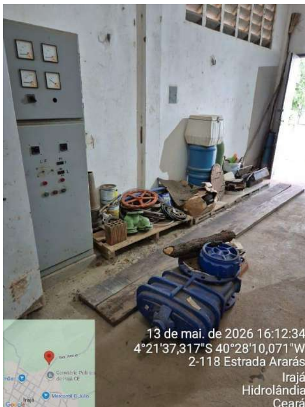
Foto 43 - ETA Irajá / Casa de Bombas: materiais armazenados inadequadamente.
