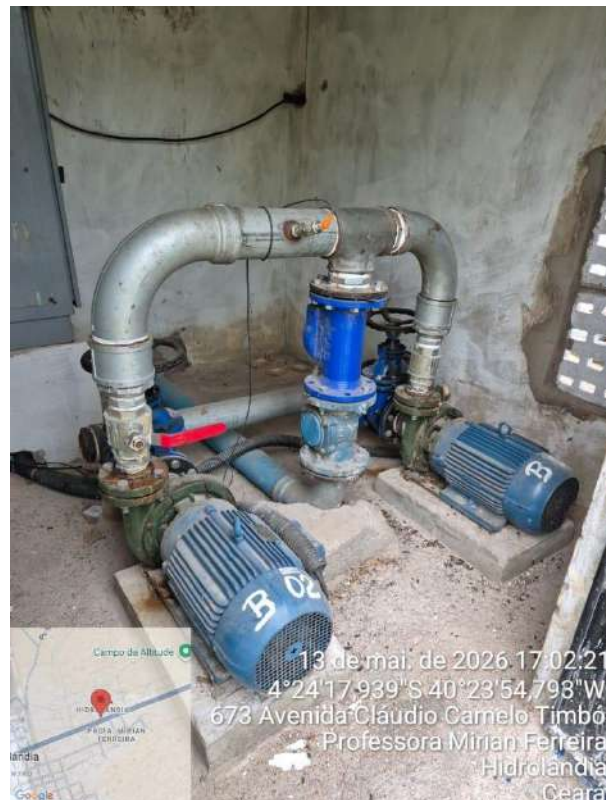
Foto 13 - EEAT-03 (Sede): equipamentos sujos e oxidados.
