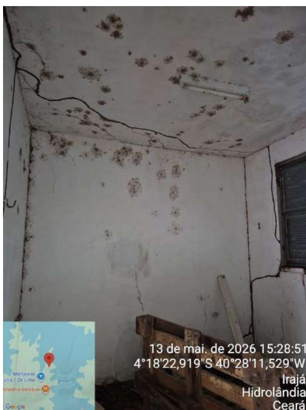
Foto 30 - EECS-01 (Irajá): pintura desgastada; presença de cupim, sujeira e entulho.
