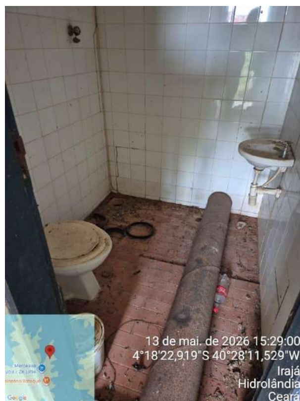
Foto 31 - EECS-01 (Irajá): presença de cupim, sujeira e entulho; banheiro inoperante.
