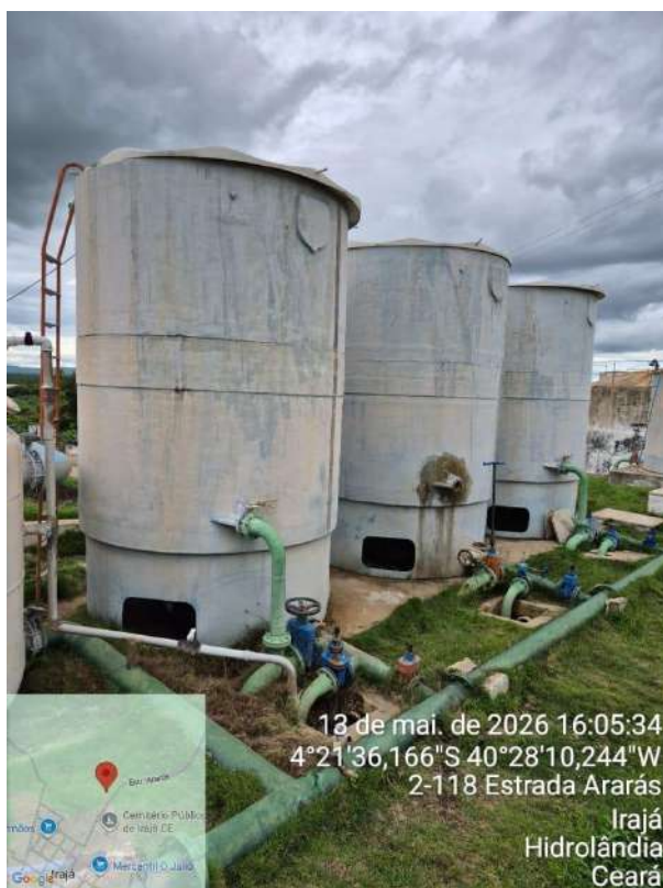
Foto 37 - ETA (Irajá): filtros F-01 a F-03 com pintura desgastada.
