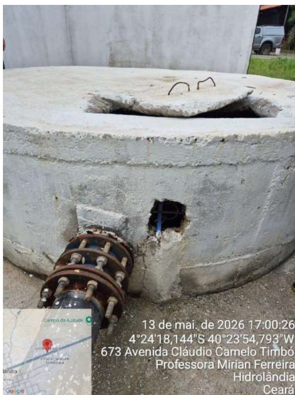
Foto 10 - EEAT-03 (Sede): tampa e proteção da bomba quebradas, e ausência de vedação na parede do poço de sucção.
