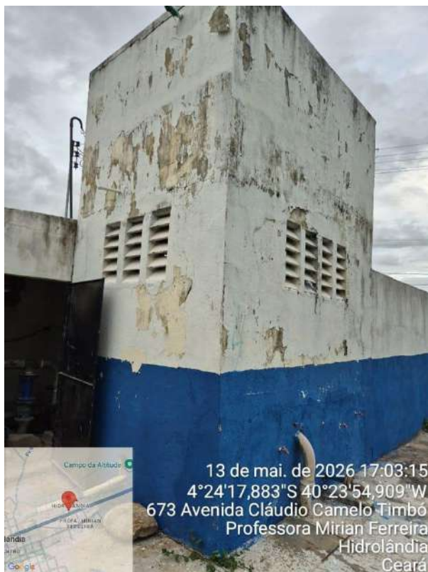
Foto 8 - EEAT-03 (Sede): paredes desgastadas.
