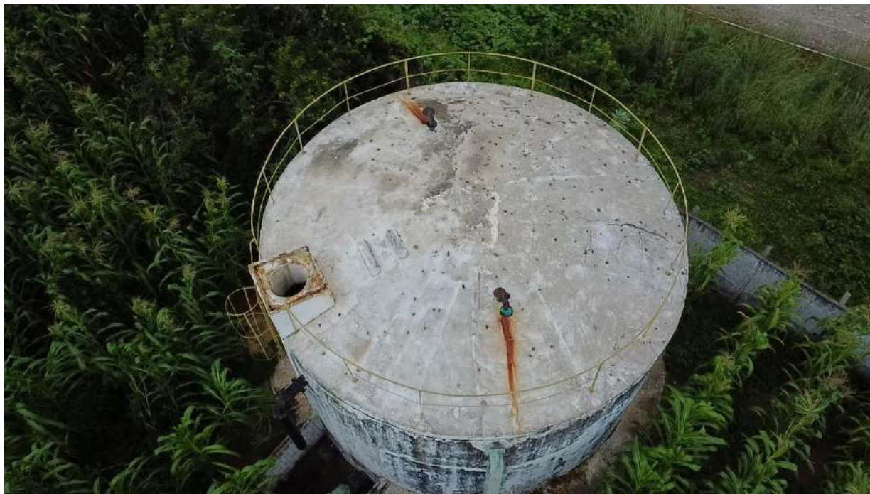
Foto 19 - RAP-04 (Sede): pintura desgastada; rachaduras na laje; tubulação de respiro oxidada.
