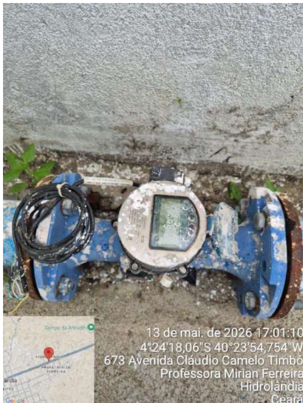
Foto 12 - EEAT-03 (Sede): equipamentos sujos e oxidados.
