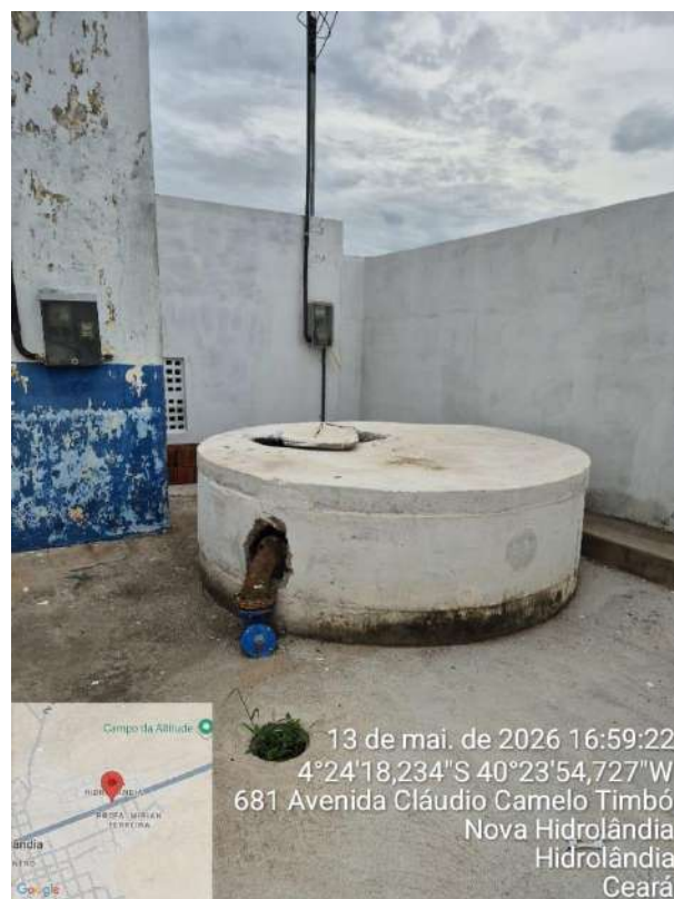
Foto 11 - EEAT-03 (Sede): equipamentos sujos e oxidados.
