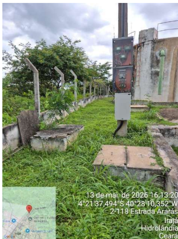
Foto 42 - ETA (Irajá): excesso de vegetação no entorno.
