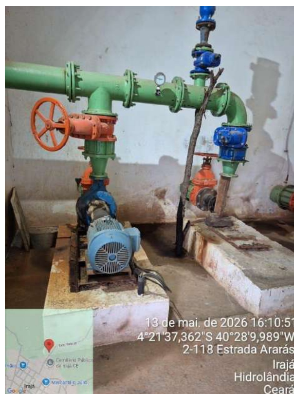
Foto 46 - ETA Irajá / Casa de Bombas: tubulação da bomba da EEAT-01 com apoio improvisado de madeira e sem bomba reserva.
