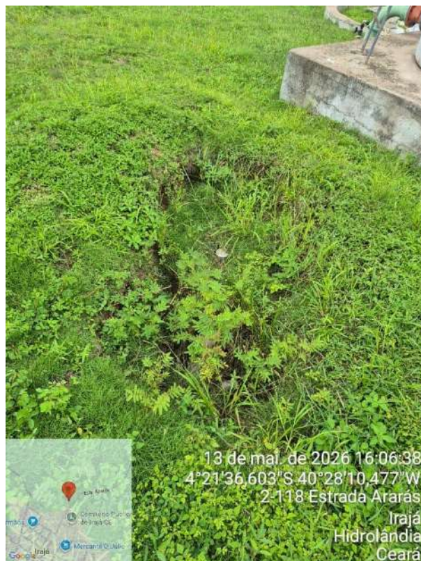
Foto 40 - ETA (Irajá): registro sem caixa e grade de proteção, coberto pela vegetação.
