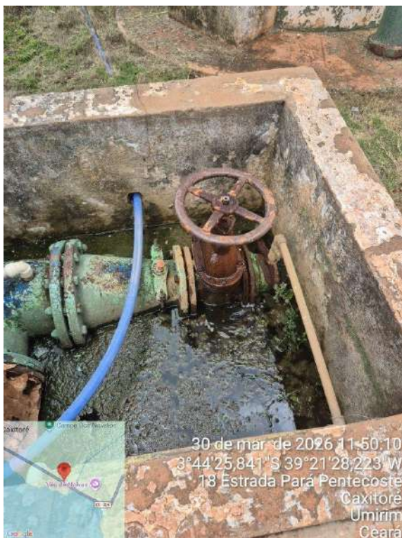
Foto 13 - ETA (Sede): registro com vazamento.
