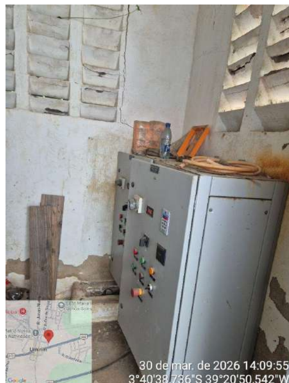
Foto 27 - EERD-01 (Sede): estação elevatória apresenta pintura e reboco deteriorados.
