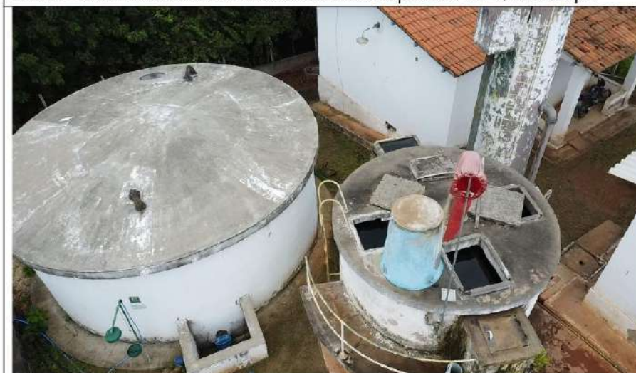
Foto 3 – Saída do filtro da ETA de Umirim sem tampa.
