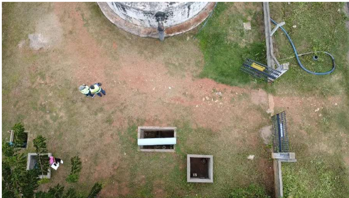
Foto 3 - Pátio ( Caxitoré ): existem diversas caixas de proteção sem tampas.
