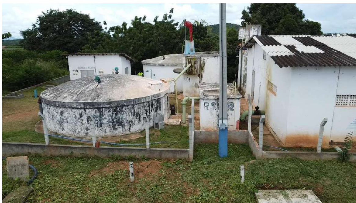
Foto 10 - ETA (Sede): infraestrutura com pintura e identificações desgastadas.
