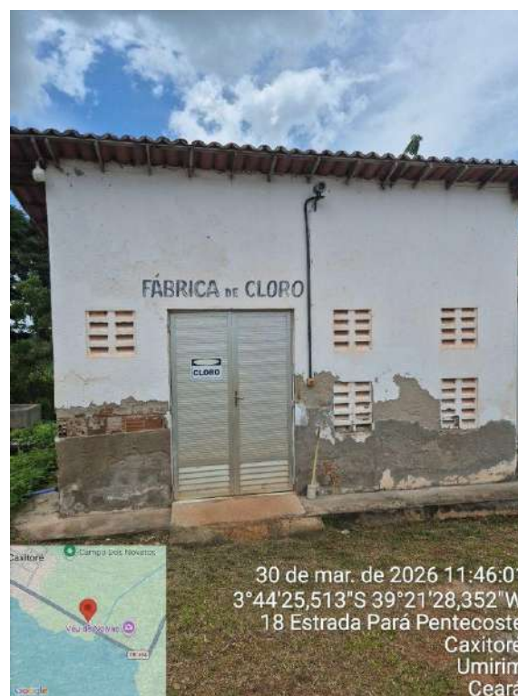
Foto 19 - ETA / Casa de Cloro (Sede): apresenta reboco deteriorado.
