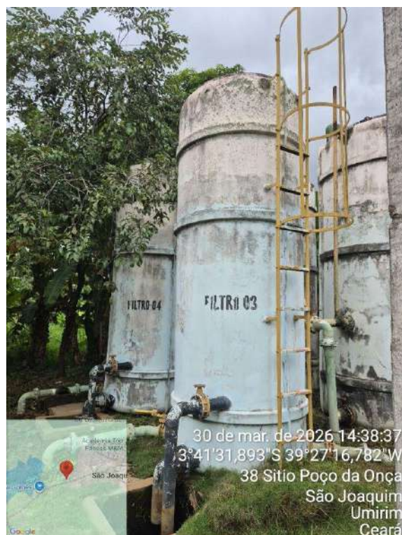
Foto 31 - ETA (São Joaquim): filtros com pintura e identificação desgastadas.
