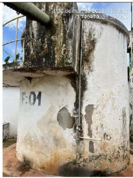
Foto 5 – Estado precário do único filtro da ETA de Umirim.
