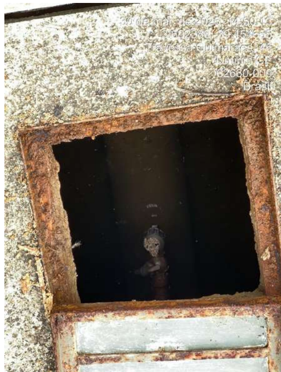
Foto 29 - ETA (São Joaquim): macromedidor encontra-se submerso e quebrado.
