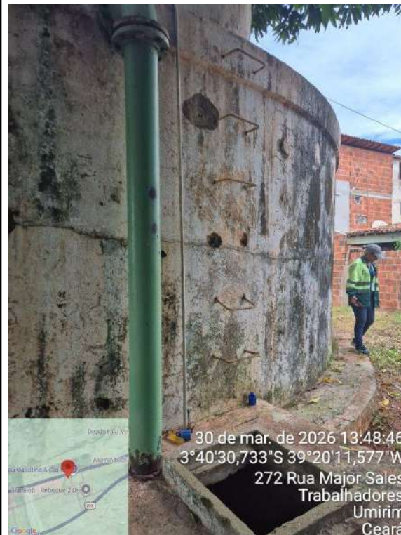
Foto 21 - RAP-01 (Sede): pintura e identificação desgastadas e escada deteriorada faltando degrau.
