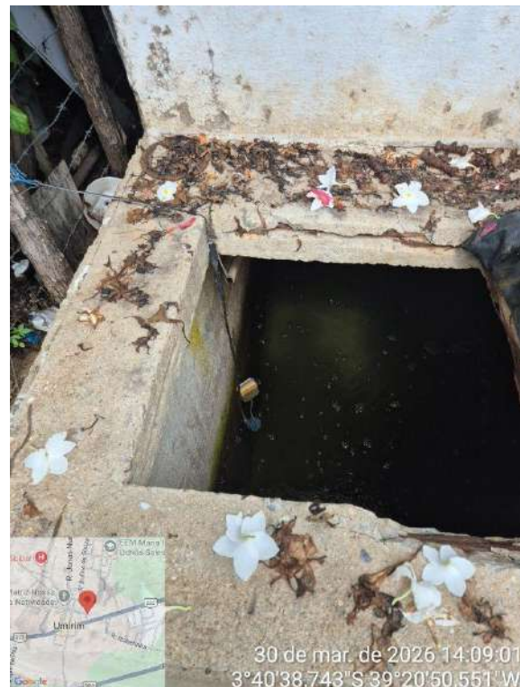
Foto 25 - EERD-01 (Sede): poço de sucção da elevatória aberto e com entrada de folhas e sujeiras.
