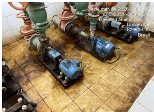
Foto 33 - EELF-01 (São Joaquim): alagamento da elevatória ao realizar descarga dos filtros.
