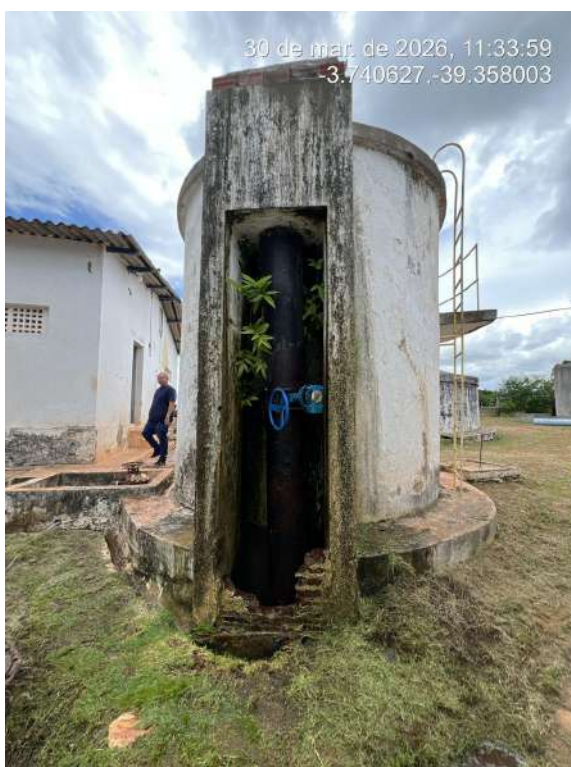
Foto 15 - F-01 (Sede): estrutura danificada com pintura e reboco deteriorado.
