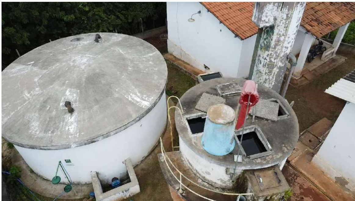
Foto 17 - F-01 (Sede): estrutura danificada com pintura e reboco deteriorado; saída do filtro sem tampa.
