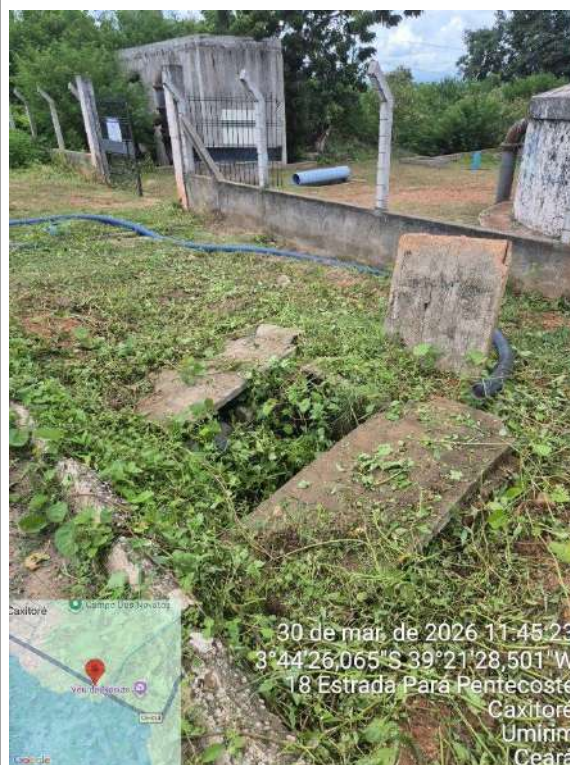
Foto 12 - ETA (Sede): caixa na área externa com tampa danificada.
