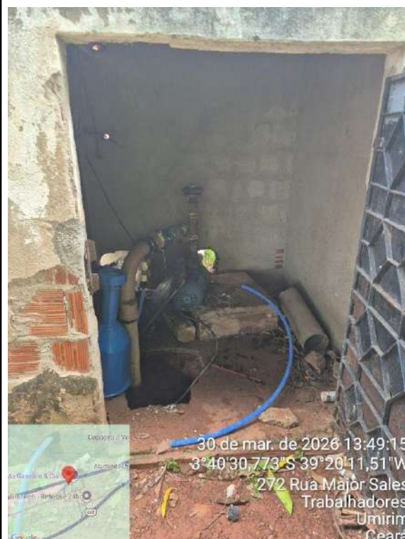
Foto 23 - EERD-02 (Sede): casa de bomba tem buraco no piso e apresenta pintura e reboco deteriorados.
