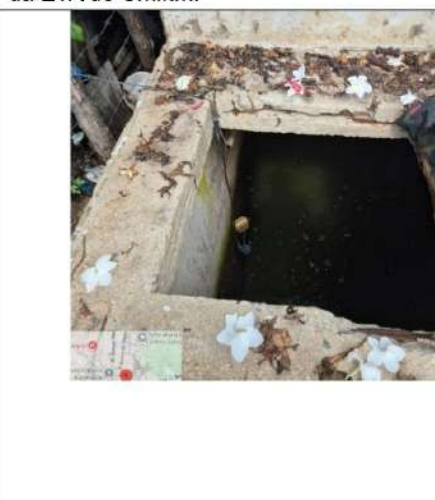
Foto 7 – Poço de sucção da EERD 01 aberto e com entrada de folha e sujeiras.
