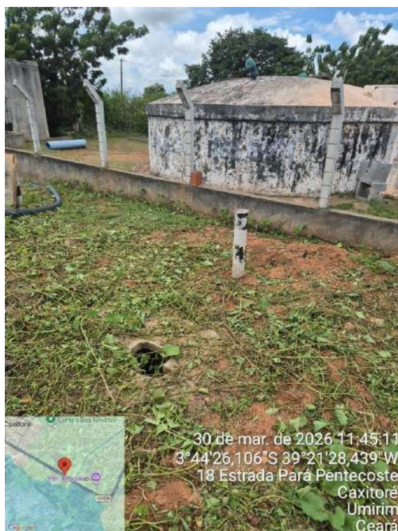
Foto 11 - ETA (Sede): caixa na área externa com tampa danificada.
