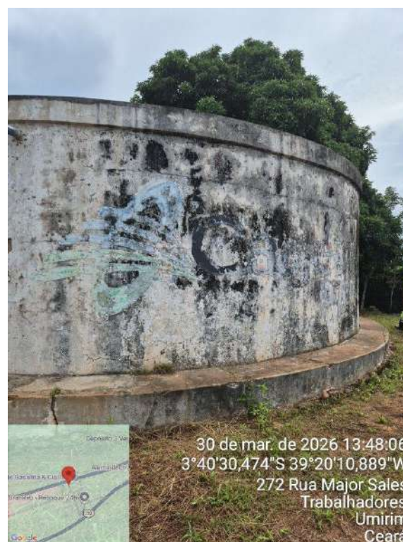
Foto 5 - RAP-01 ( Sede ): o reservatório não possui grade de proteção no patamar superior e torre de nível.
