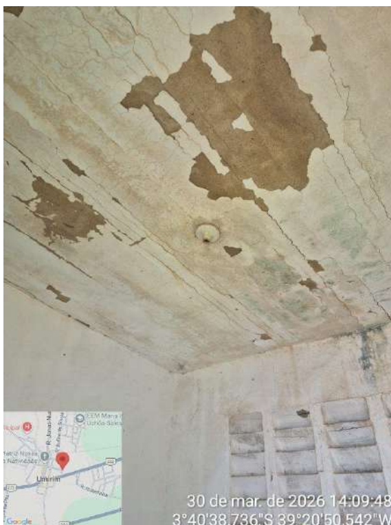
Foto 26 - EERD-01 (Sede): estação elevatória apresenta pintura e reboco deteriorados, ausência de lâmpada.
