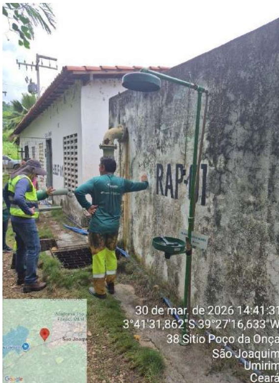
Foto 32 - RAP-01 (São Joaquim): pintura desgastada.
