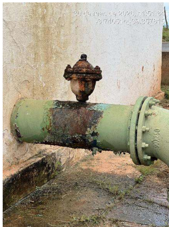
Foto 14 - ETA (Sede): ventosa em péssimo estado de conservação.
