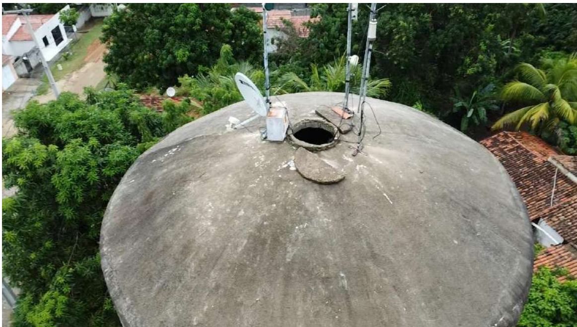
Foto 35 - REL-01 (São Joaquim): apresenta pintura e identificação desgastada.
