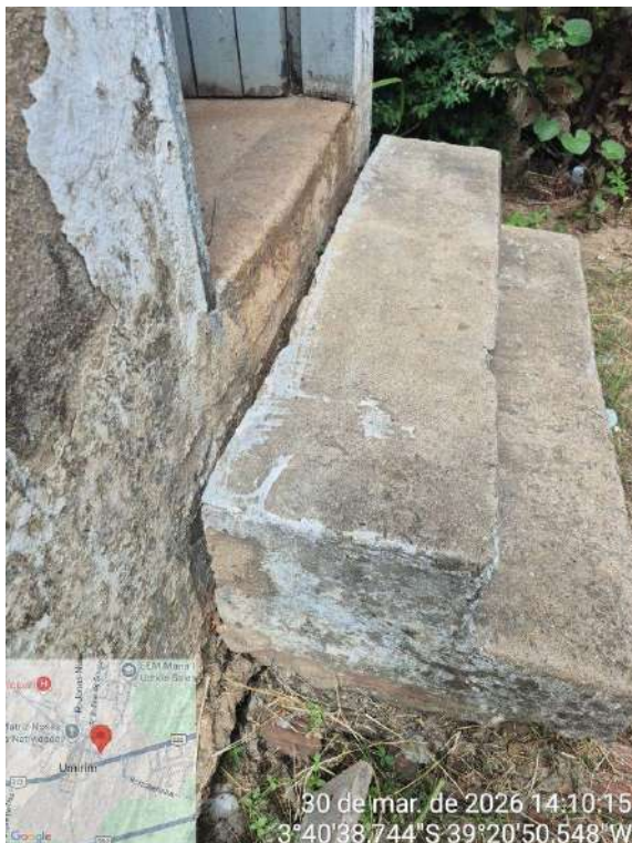
Foto 28 - EERD-01 (Sede): escada de acesso instável.
