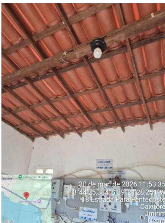
Foto 18 - ETA / Casa de Cloro (Sede): lâmpada não acende.
