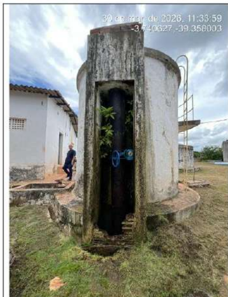
Foto 4 – Estado precário do único filtro da ETA de Umirim.
