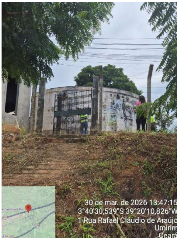
Foto 20 - RAP-01 (Sede): acesso difícil ao reservatório, com pintura e identificação desgastadas.
