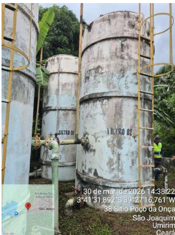
Foto 30 - ETA (São Joaquim): filtros com pintura e identificação desgastadas.
