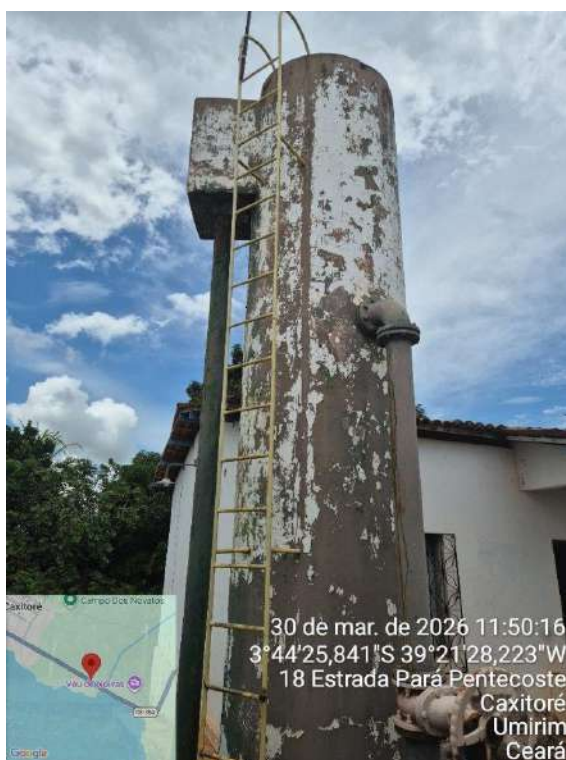
Foto 4 - Torre de Nível ( Caxitoré ): escada tipo marinho não tem gaiola de proteção.
