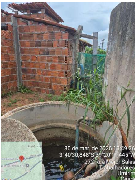
Foto 22 - EERD-02 (Sede): poço de sucção aberto e exposto a sujeiras. Na tela ao lado, fica localizado um galinheiro.
