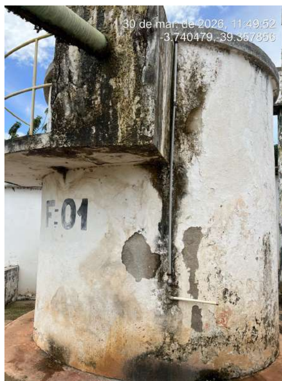
Foto 16 F-01 (Sede): estrutura danificada com pintura e reboco deteriorado.
