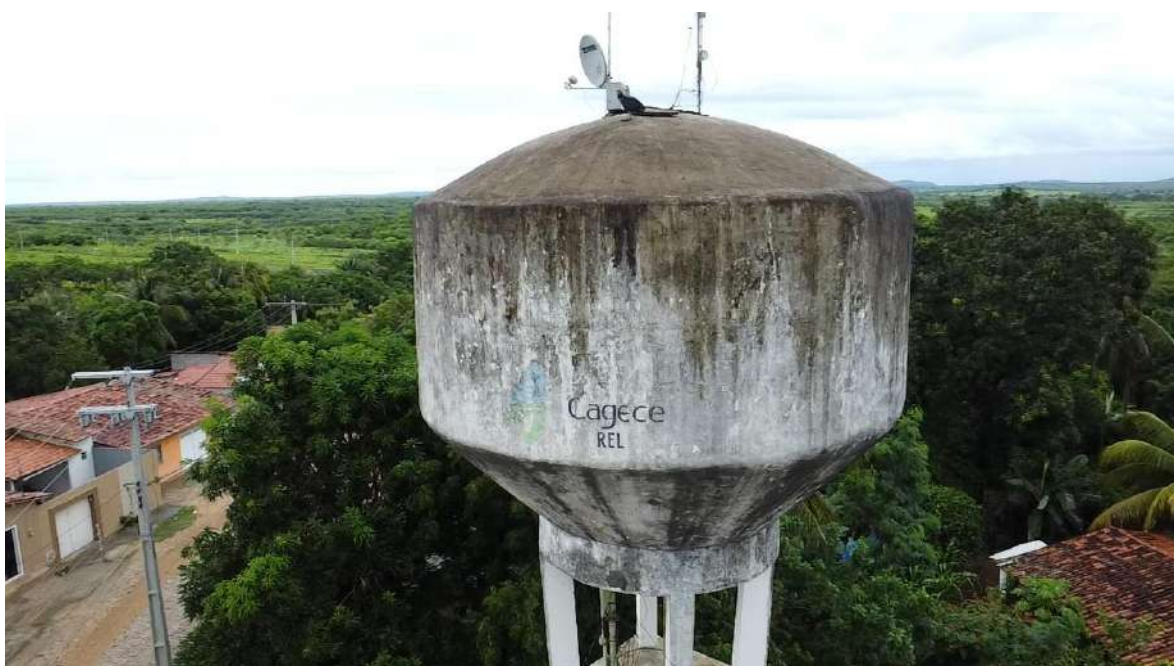
Foto 34 - REL-01 (São Joaquim): apresenta pintura e identificação desgastada; presença de urubu na cúpula do reservatório.
