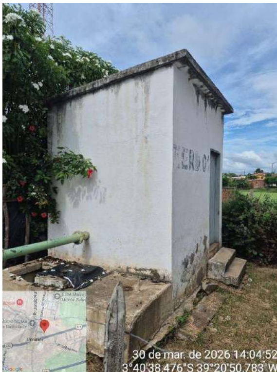
Foto 24 - EERD-01 (Sede): estação elevatória apresenta pintura e reboco deteriorados, poço de sucção da elevatória aberta.
