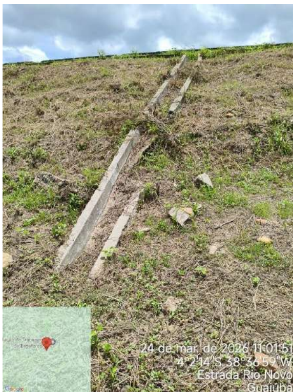
Foto 83 - ETE Guaiúba: canaleta de drenagem deteriorada.
