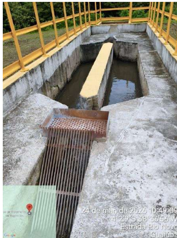
Foto 26 - ETE Guaiúba: tratamento preliminar não possui comportas divisórias.
