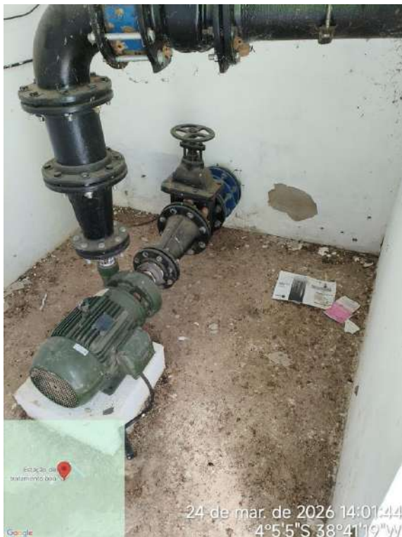
Foto 65 - Captação / Casa de Bombas (Dourado): parede desgastada, piso com sujeira.
