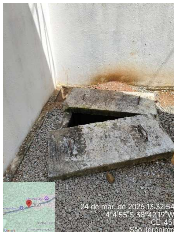
Foto 71 - ETA Dourado: caixa de inspeção com tampa inadequada fora do lugar.
