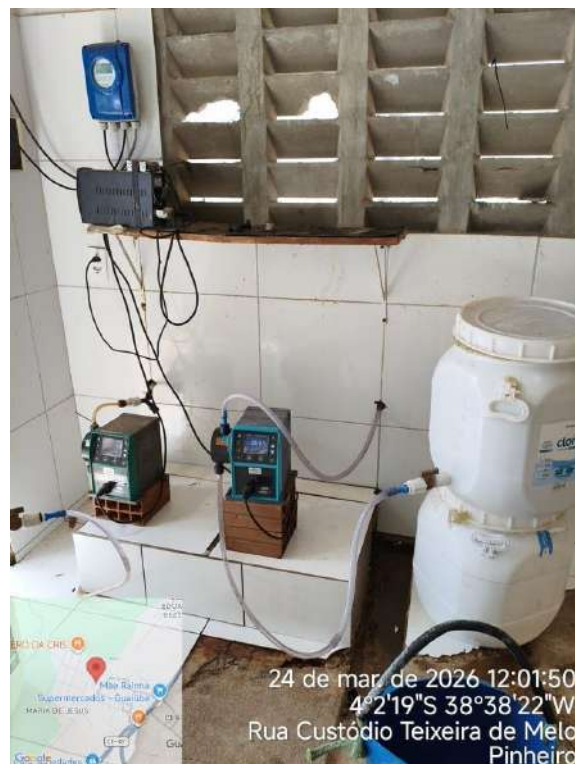
Foto 12 - ETA Guaiúba / Casa de Química: instalações improvisadas tanto no tratamento quanto nas instalações elétricas.
