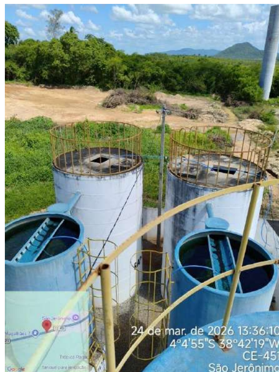
Foto 19 - ETA Dourado: filtros e reservatórios sem tampas.
