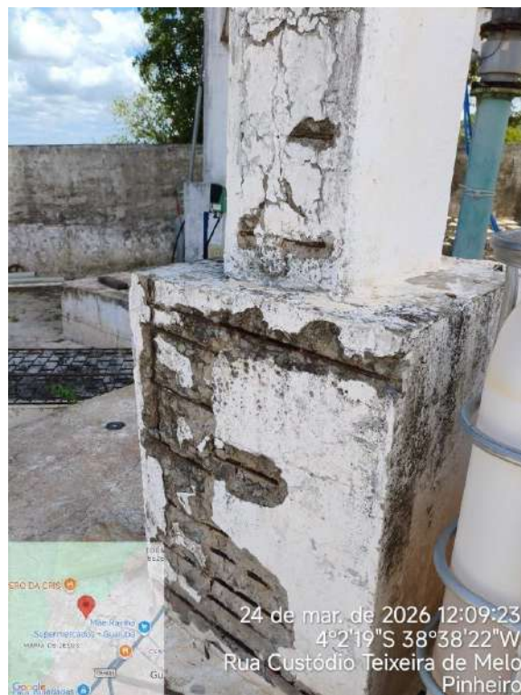
Foto 59 - ETA Guaiúba / REL-01: infraestrutura deteriorada, com pilares, vigas e laje com ferragens expostas.
