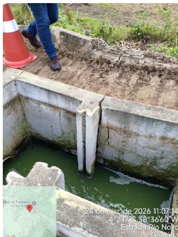
Foto 90 - ETE Guaiúba: caixa de esgoto sem tampa e em processo de deterioração.
