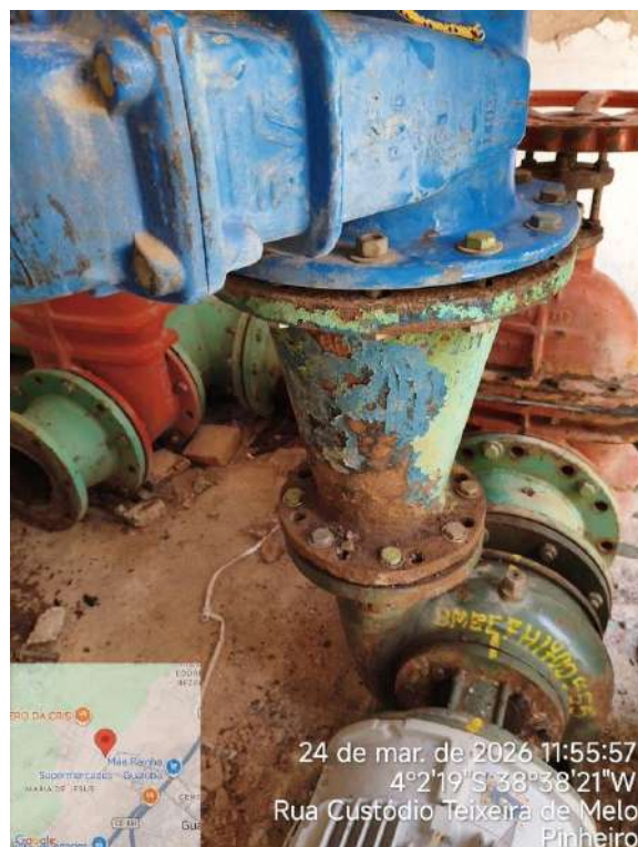
Foto 49 - ETA Guaiúba / Casa de Bombas: tubulações de água em processo de corrosão.
