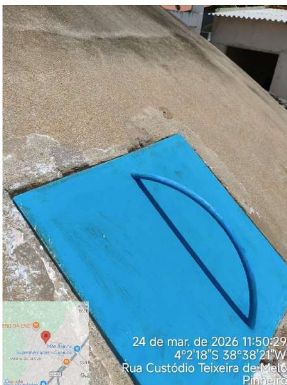
Foto 5 - ETA Guaiúba / RAP-01: tampa de inspeção não possui fechamento hermético, permitindo a entrada de água da chuva.
