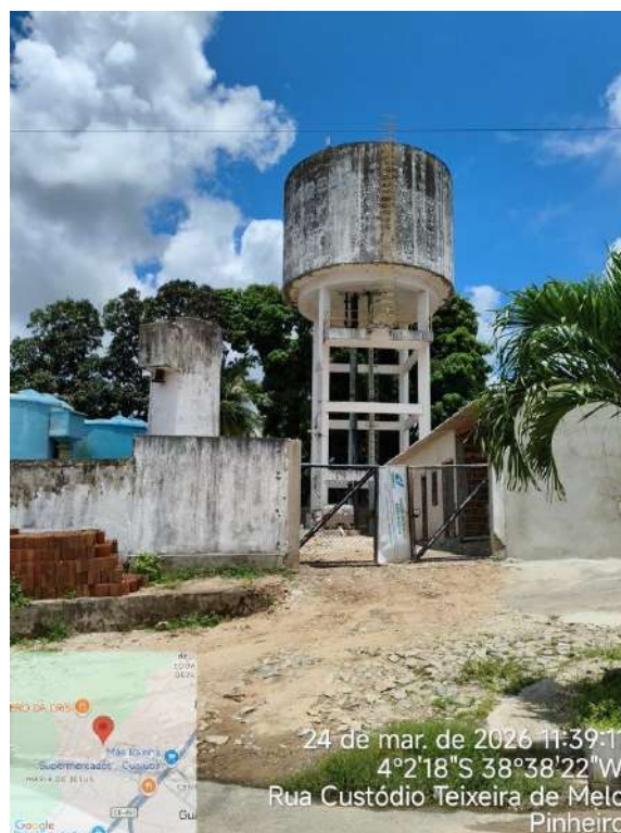
Foto 31 - ETA Guaiúba / Geral: portão sem fechamento adequado e com pintura do muro desgastada.
