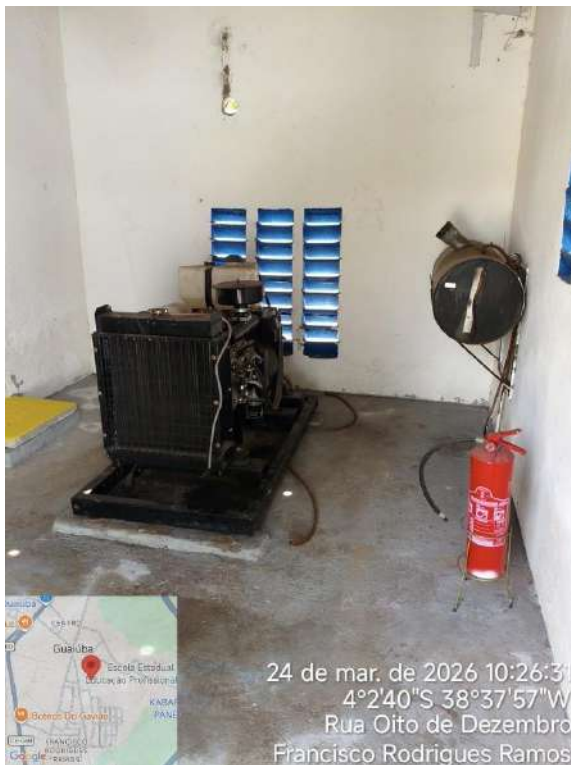
Foto 75 - EEE-03 (Sede): grupo gerador está parado.
