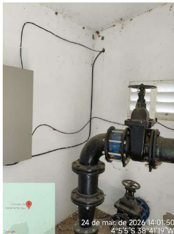
Foto 15 - Captação / Casa de Bombas (Dourado): fio/cabo inadequado.
