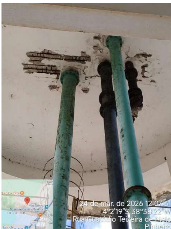
Foto 56 - ETA Guaiúba / REL-01: infraestrutura deteriorada, com ferragens expostas.
