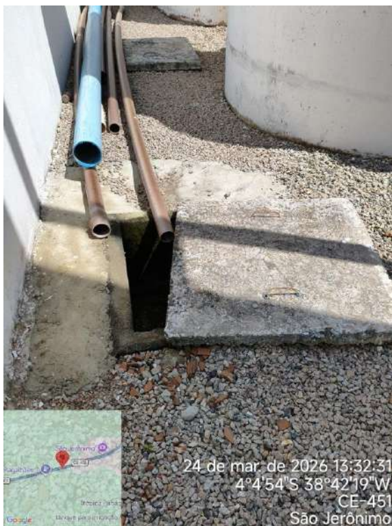
Foto 72 - ETA Dourado: caixa de inspeção com tampa inadequada fora do lugar.
