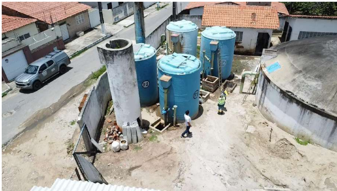
Foto 36 - ETA Guaiúba / Geral: a iluminação externa do pátio está precária, especialmente na área dos filtros e do reservatório apoiado, cuja luminária foi desativada.
