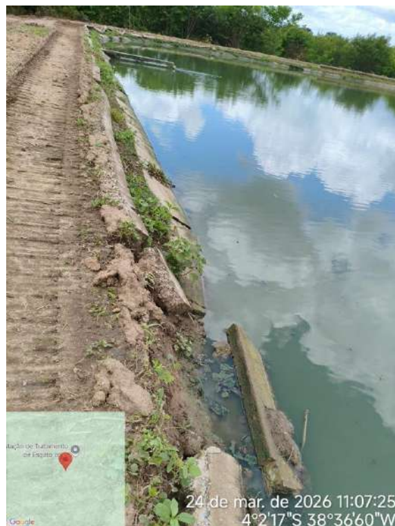
Foto 88 - ETE Guaiúba: meios-fios da lagoa deteriorados.
