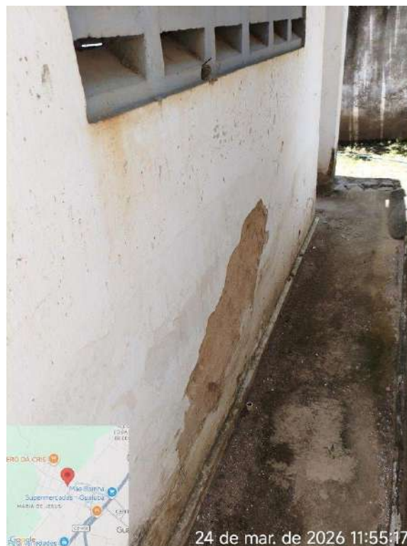
Foto 43 - ETA Guaiúba / Casa de Bombas: revestimentos deteriorados.
