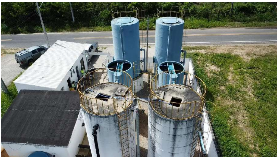
Foto 20 - ETA Dourado: filtros e reservatórios sem tampas, instalação elétrica e hidráulica dos RAPs estão implantadas inadequadamente através da abertura de inspeção.
