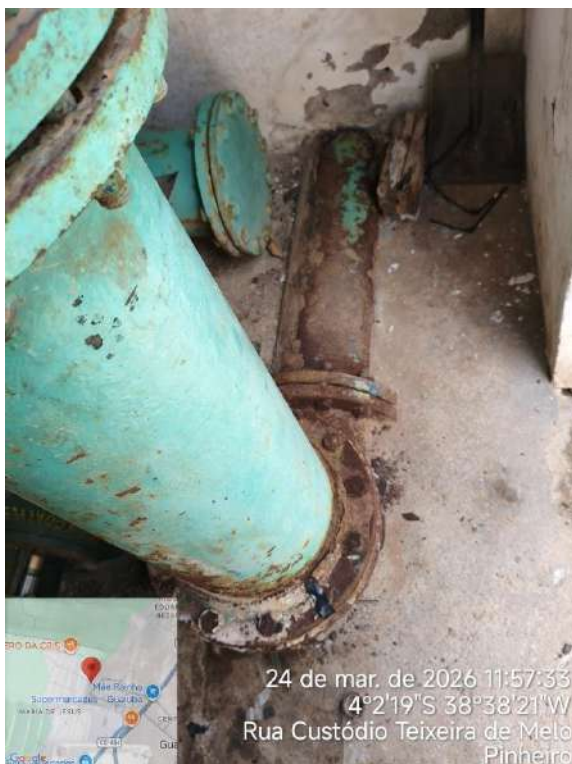
Foto 50 - ETA Guaiúba / Casa de Bombas: tubulações de água em processo de corrosão.
