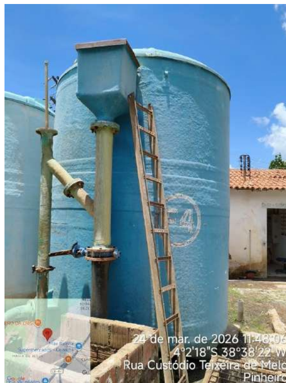
Foto 40 - ETA Guaiúba / Torre e Filtros: filtros com problemas de acesso, sem escada ou com escada tipo marinheiro inadequada.
