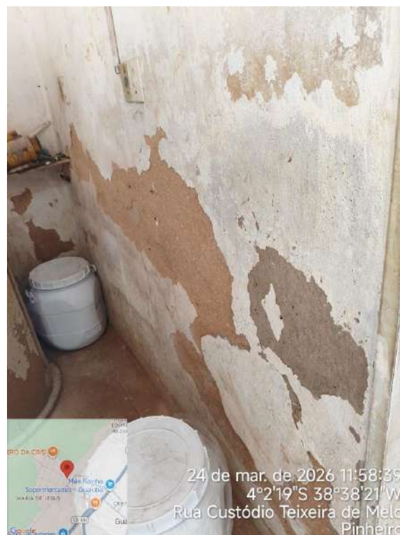
Foto 10 - ETA Guaiúba / Casa de Química: instalações improvisadas tanto no tratamento quanto nas instalações elétricas.
