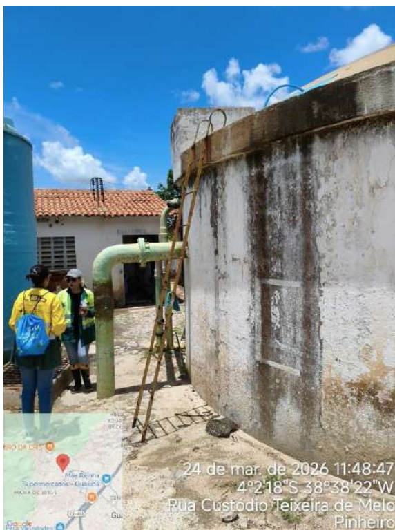
Foto 3 - ETA Guaiúba / RAP-01: escada tipo marinheiro inadequada sem gaiola de proteção e sem grade de proteção no patamar superior.
