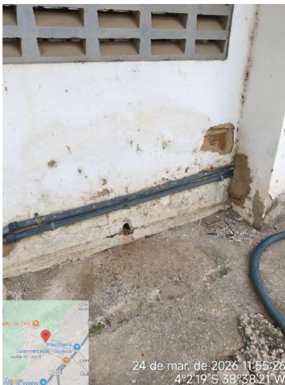
Foto 46 - ETA Guaiúba / Casa de Bombas: revestimentos deteriorados, piso com sujeira acumulada.
