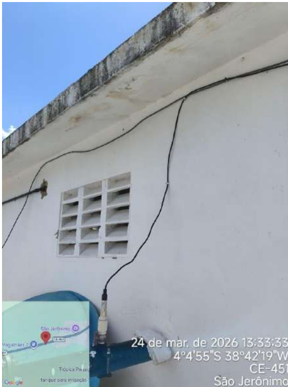
Foto 21 - ETA Dourado / Casa de Química: instalações elétricas precárias, implantadas de forma inadequada através de cobogós e sem eletrodutos de isolamento e proteção.
