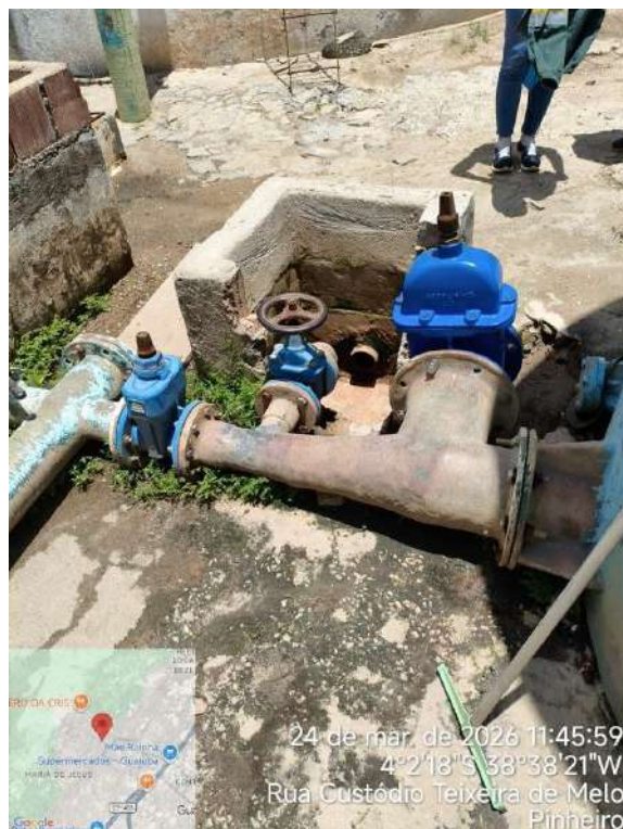
Foto 33 - ETA Guaiúba / Geral: caixas de proteção deterioradas.
