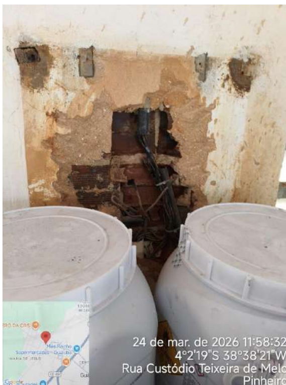
Foto 9 - ETA Guaiúba / Casa de Química: instalações improvisadas tanto no tratamento quanto nas instalações elétricas.
