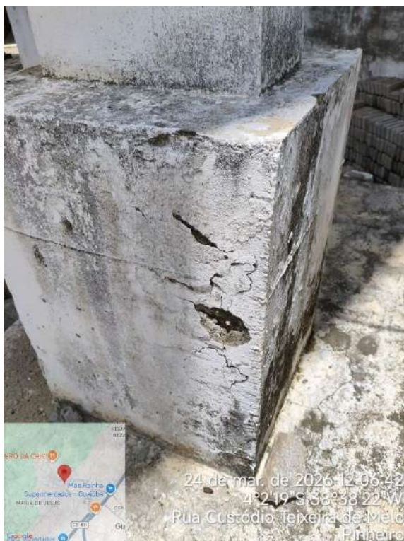
Foto 60 - ETA Guaiúba / REL-01: infraestrutura deteriorada, com pilares, vigas e laje com ferragens expostas.
