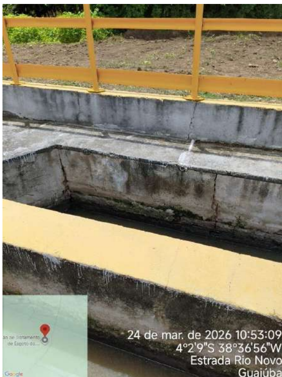
Foto 77 - ETE Guaiúba: revestimento do tratamento preliminar sem acabamento.
