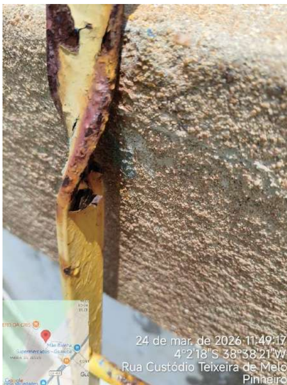
Foto 42 - ETA Guaiúba / RAP-01: escada tipo marinho inadequada, com estrutura oxidada.
