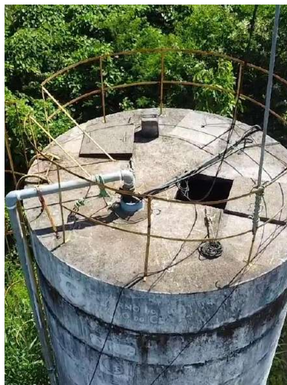
Foto 17 - Captação / RAP-01 (Dourado): fios/cabos inadequados.
