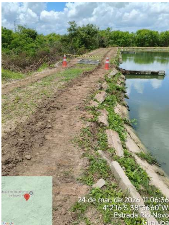
Foto 87 - ETE Guaiúba: meios-fios da lagoa deteriorados.
