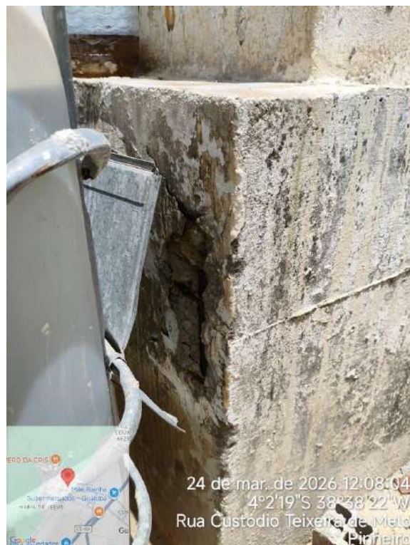
Foto 61 - ETA Guaiúba / REL-01: infraestrutura deteriorada, com pilares, vigas e laje com ferragens expostas.
