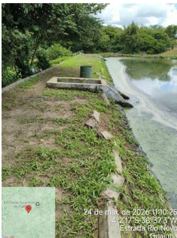
Foto 27 - ETE Guaiúba: caixa sem tampa de proteção na área de circulação.
