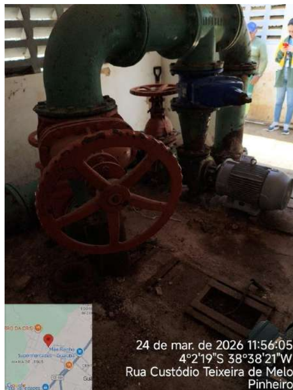
Foto 47 - ETA Guaiúba / Casa de Bombas: está faltando uma das bombas e a bomba reserva não se encontra instalada.
