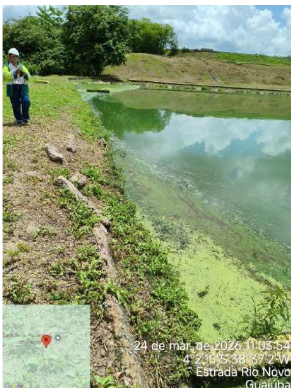
Foto 85 - ETE Guaiúba: meios-fios da lagoa deteriorados.
