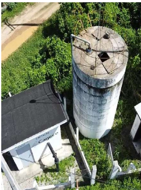
Foto 16 - Captação / RAP-01 (Dourado): fios/cabos inadequados.
