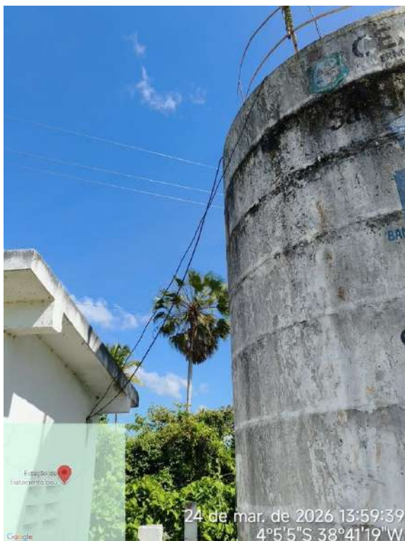
Foto 68 - Captação / RAP-01 (Dourado): fiação inadequada.
