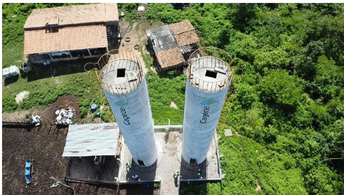
Foto 74 - REL-01 e 02 (Dourado): reservatórios com tampa fora do lugar.
