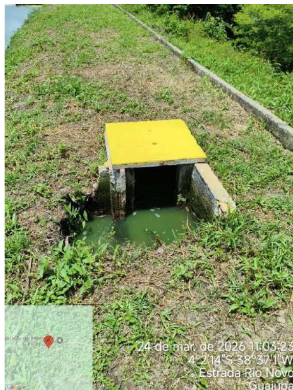
Foto 80 - ETE Guaiúba: caixas de esgoto na área de circulação danificadas.
