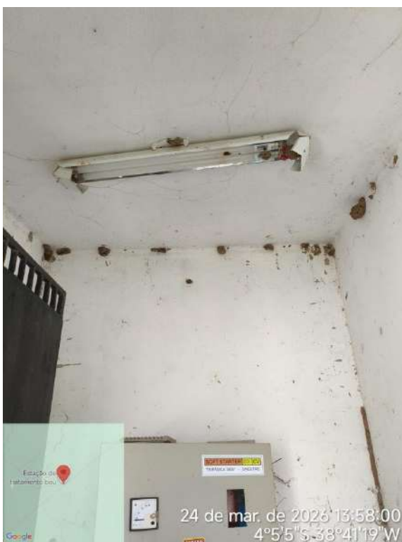
Foto 63 - Captação / Casa de Bombas (Dourado): parede com sujidade e cupim.
