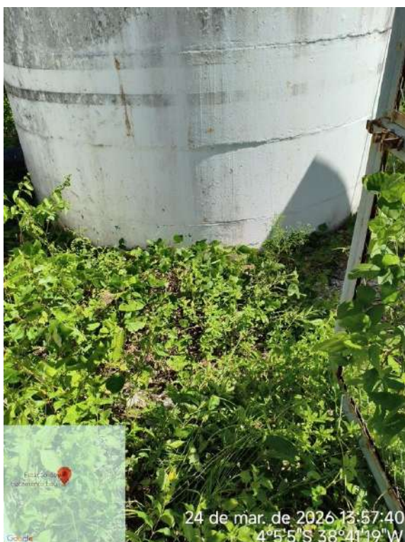
Foto 70 - Captação / RAP-01 (Dourado): presença de vegetação alta.
