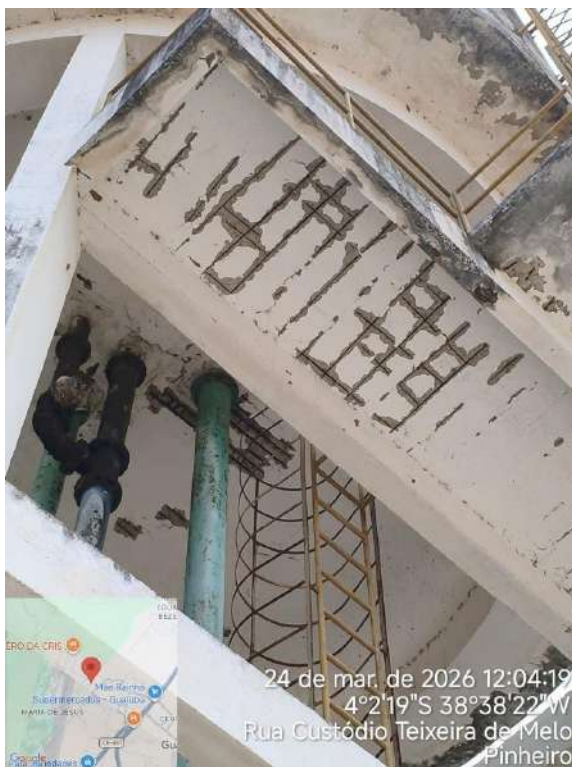
Foto 54 - ETA Guaiúba / REL-01: infraestrutura deteriorada, com ferragens expostas.
