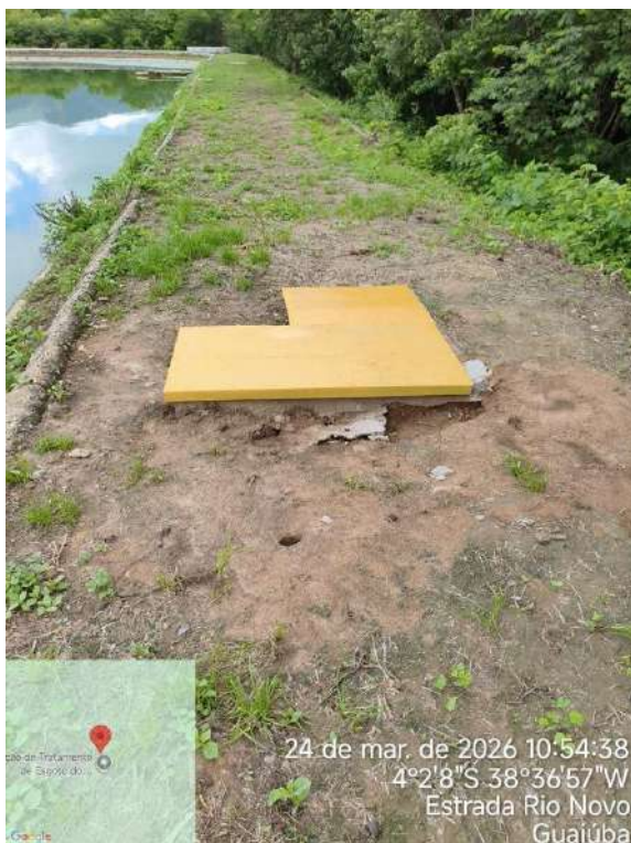
Foto 79 - ETE Guaiúba: taludes em processo de erosões e placas de proteção deterioradas.
