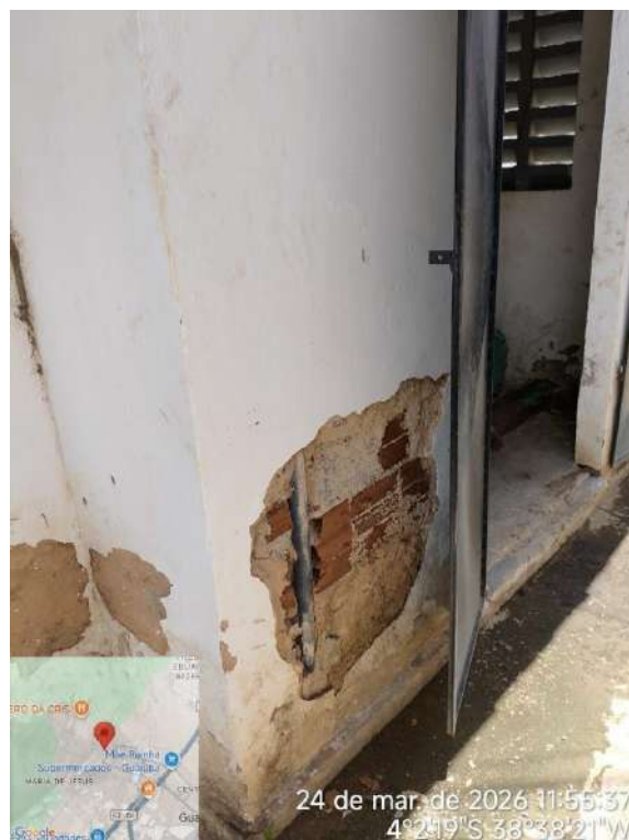
Foto 45 - ETA Guaiúba / Casa de Bombas: revestimentos deteriorados.
