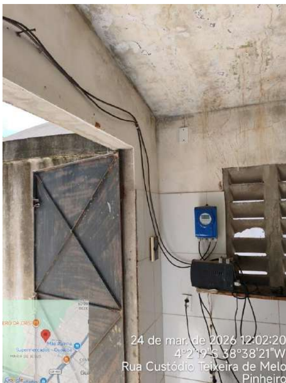
Foto 11 - ETA Guaiúba / Casa de Química: instalações improvisadas tanto no tratamento quanto nas instalações elétricas.
