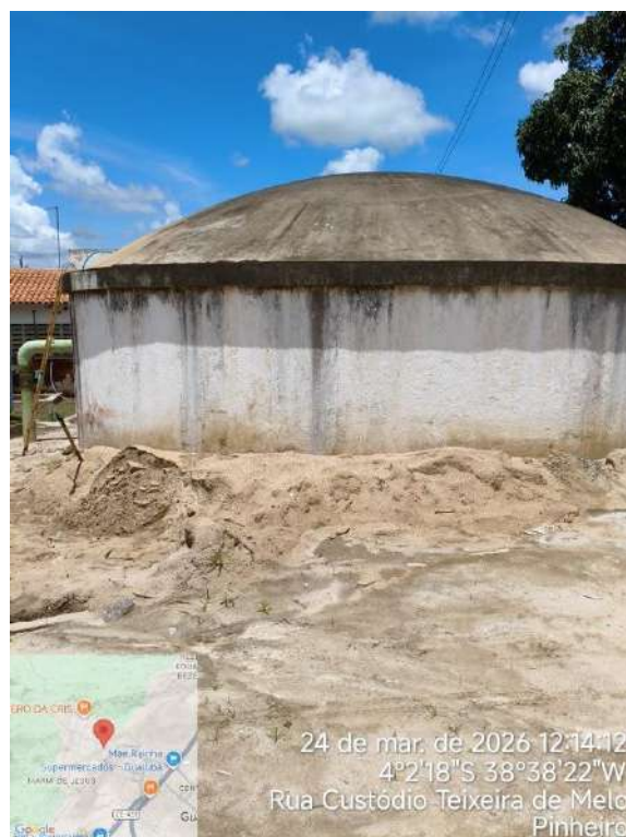
Foto 6 - ETA Guaiúba / RAP-01: não existe tubulação de ventilação na laje superior do reservatório.
