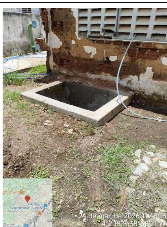
Foto 2 - ETA Guaiúba / Geral: caixa sem tampa ou grade de proteção.
