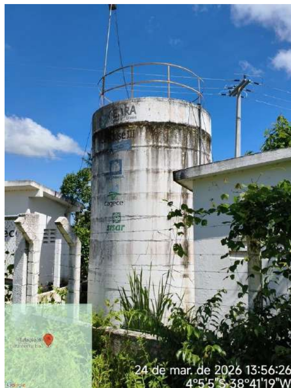
Foto 69 - Captação / RAP-01 (Dourado): parede do RAP com indício de infiltração/vazamento.
