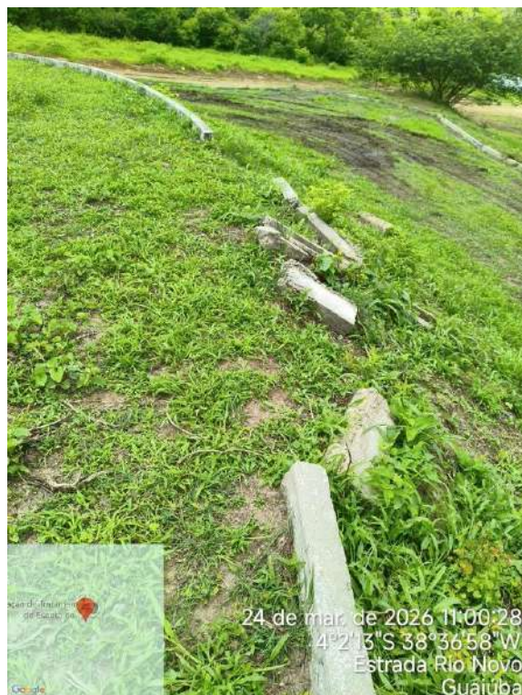
Foto 84 - ETE Guaiúba: meios-fios da lagoa deteriorados.
