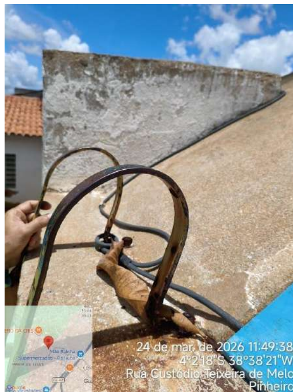
Foto 4 - ETA Guaiúba / RAP-01: fiação sobre a laje do reservatório, preso à infraestrutura da escada e adentrando o reservatório por meio da caixa de abertura de inspeção.
