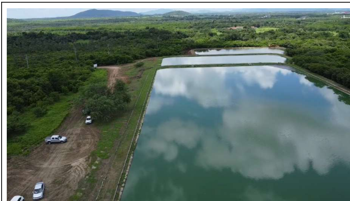
Foto 29 - ETE Guaiúba: a estação não possui casa de apoio para operador.
