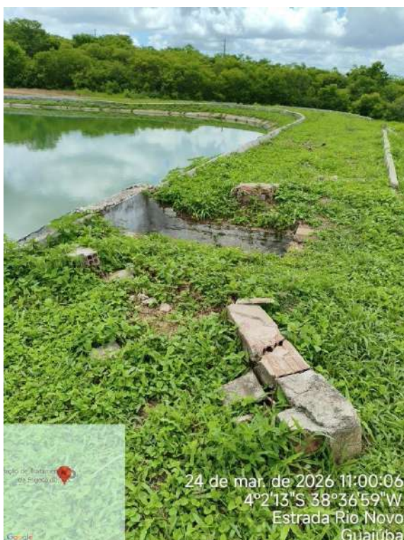
Foto 81 - ETE Guaiúba: caixas de esgoto na área de circulação danificadas.
