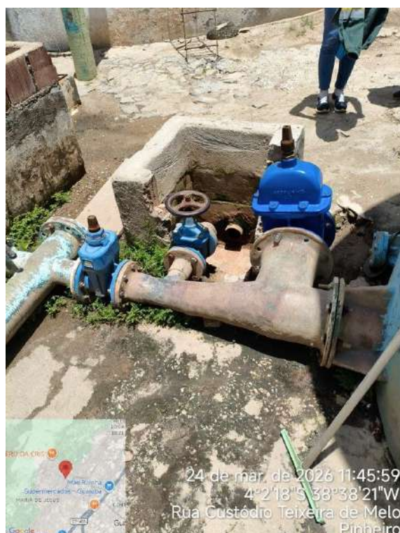
Foto 35 - ETA Guaiúba / Geral: caixas de proteção deterioradas.
