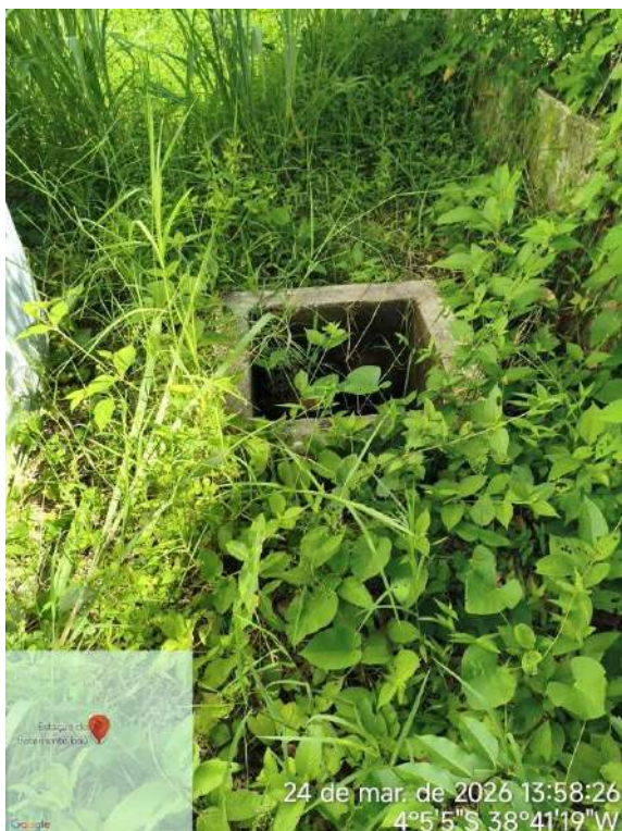
Foto 18 - Captação / RAP-01 (Dourado): caixa sem tampa.
