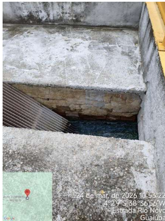
Foto 76 - ETE Guaiúba: revestimento do tratamento preliminar sem acabamento.
