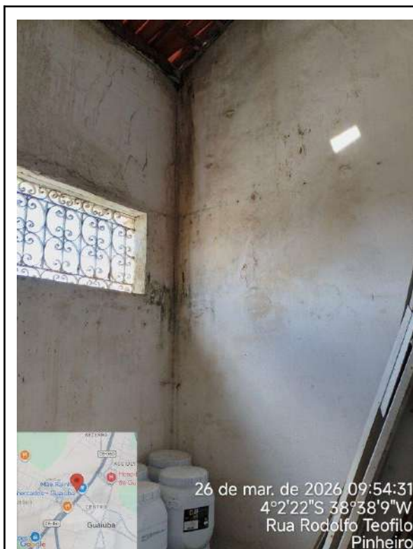
Foto 30 - Núcleo Guaiúba : almoxarifado com parede com mofo e sujidade.
