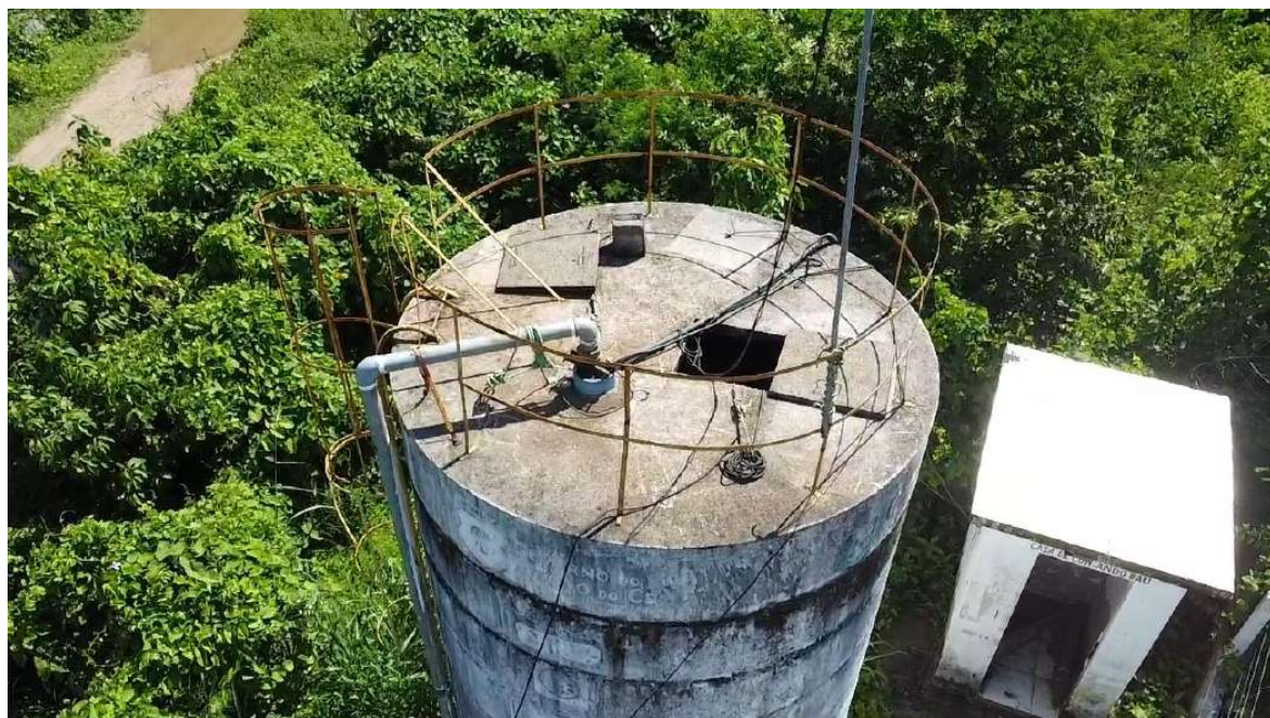
Foto 67 - Captação / RAP-01 (Dourado): fiação sem proteção adequada e com tampa deslocada.
