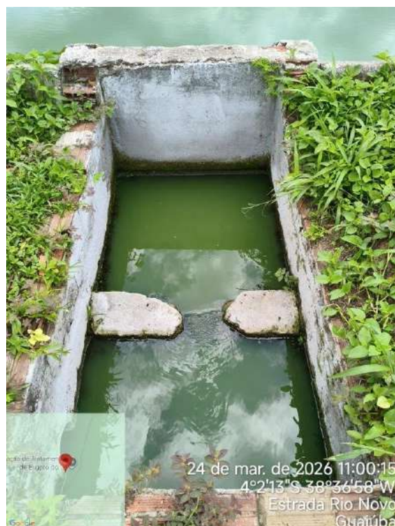
Foto 82 - ETE Guaiúba: caixas de esgoto na área de circulação danificadas.
