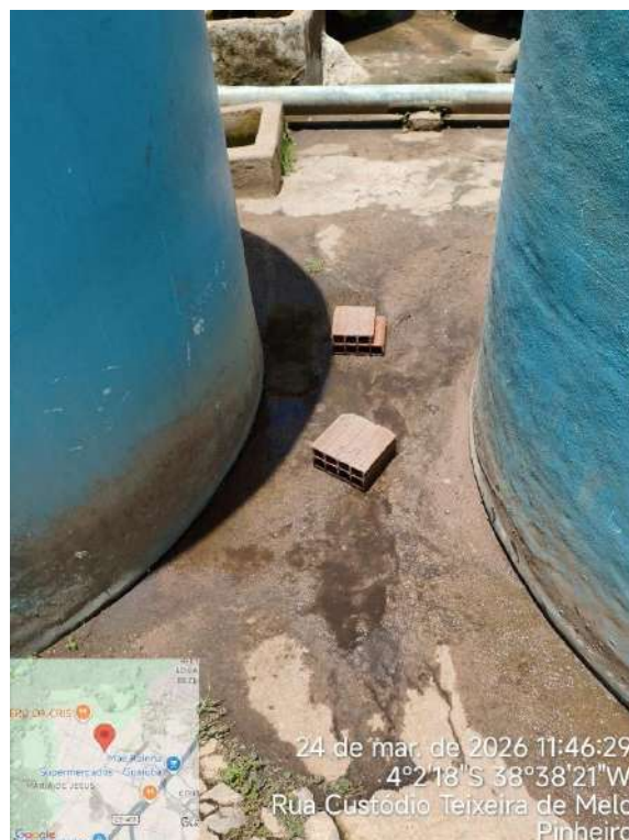
Foto 38 - ETA Guaiúba / Torre e Filtros: área do pátio apresenta água empoçada.
