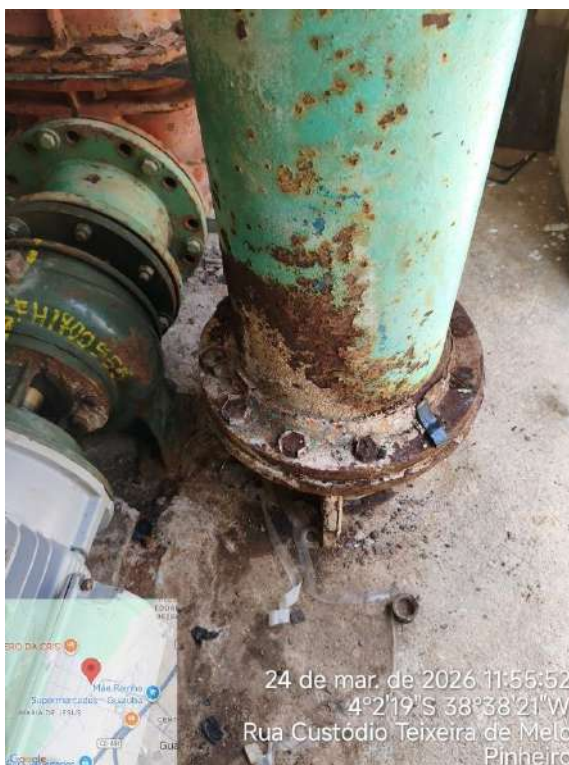
Foto 48 - ETA Guaiúba / Casa de Bombas: tubulações de água em processo de corrosão.
