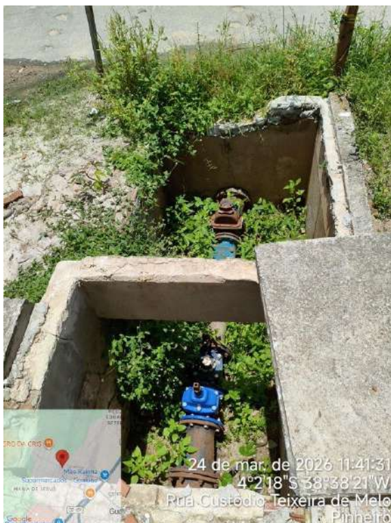
Foto 32 - ETA Guaiúba / Geral: caixa de proteção e de inspeção de dispositivos da adutora na entrada da ETA está totalmente deteriorada.
