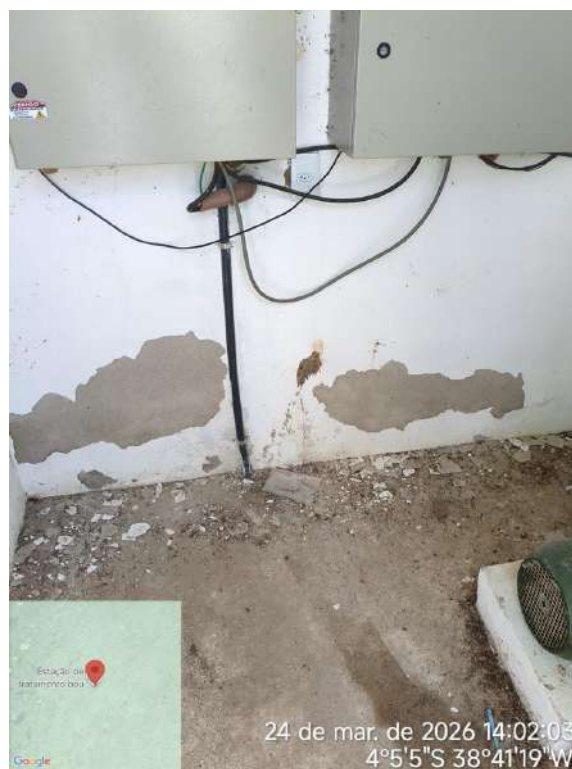
Foto 64 - Captação / Casa de Bombas (Dourado): parede com revestimento deteriorado e piso com sujeira acumulada.
