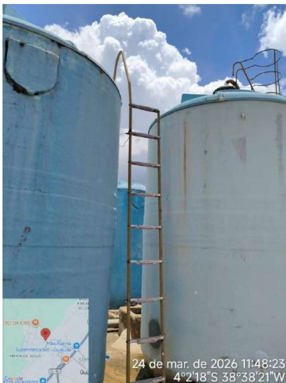
Foto 39 - ETA Guaiúba / Torre e Filtros: filtros com problemas de acesso, sem escada ou com escada tipo marinheiro inadequada.
