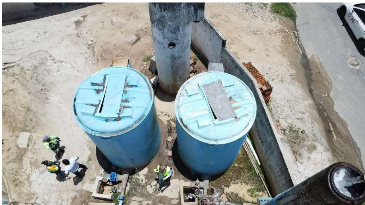
Foto 41 - ETA Guaiúba / Torre e Filtros: filtros com tampas inadequadas e com acúmulo de sujeira na cobertura.
