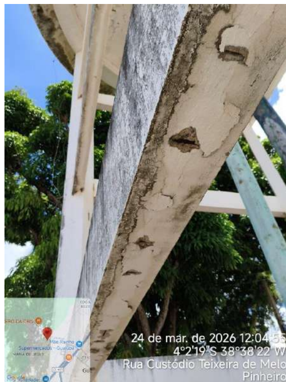
Foto 55 - ETA Guaiúba / REL-01: infraestrutura deteriorada, com ferragens expostas.
