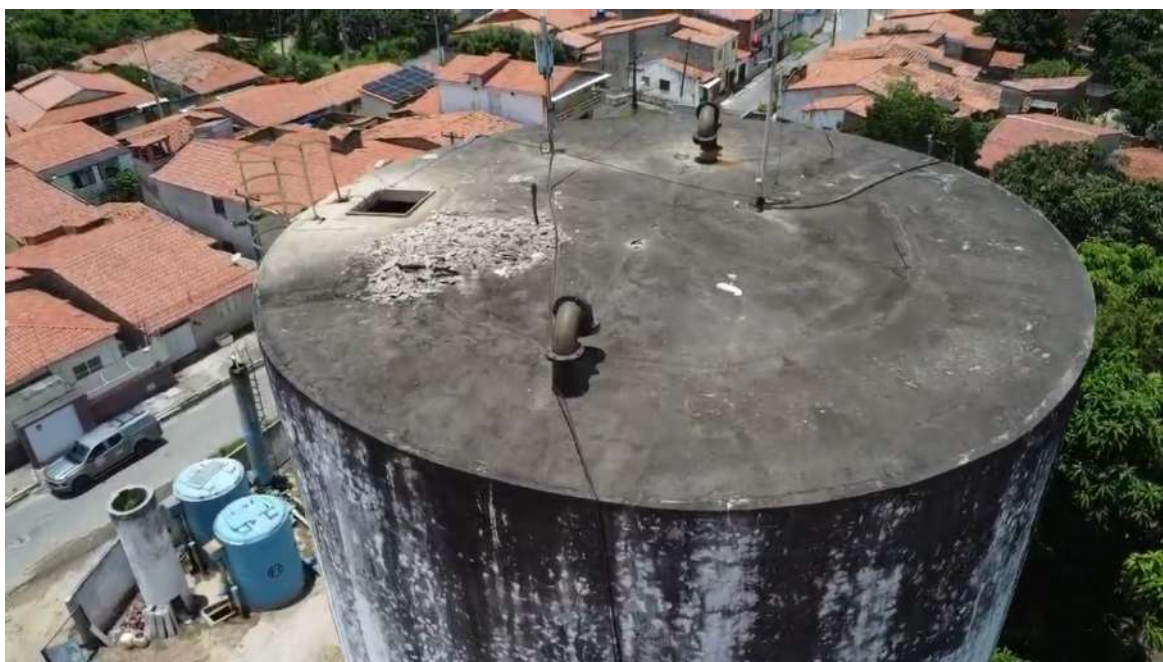
Foto 13 - ETA Guaiúba / REL-01: sem tampa e não possui grade de proteção na laje superior.
