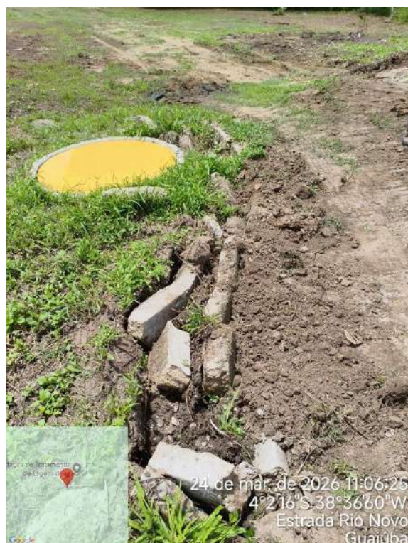
Foto 86 - ETE Guaiúba: meios-fios da lagoa deteriorados.
