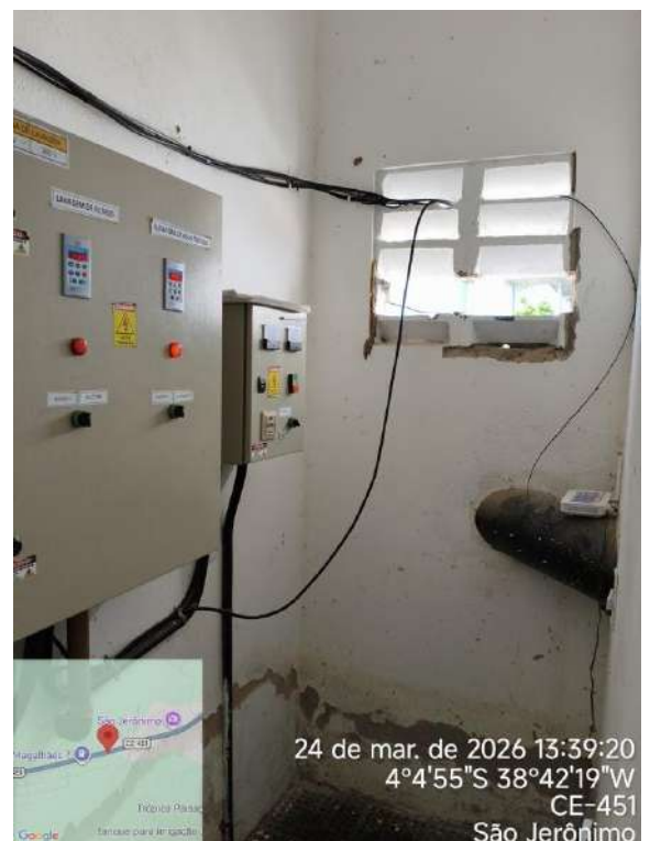
Foto 24 - ETA Dourado / Casa de Química: instalações elétricas precárias, implantadas de forma inadequada através de cobogós e sem eletrodutos de isolamento e proteção.
