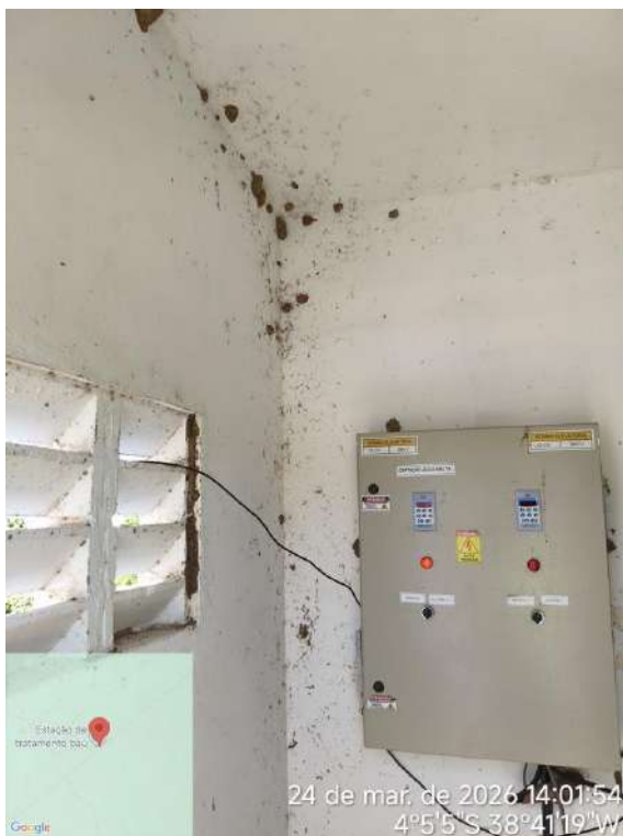
Foto 14 - Captação / Casa de Bombas (Dourado): fio/cabo inadequado.
