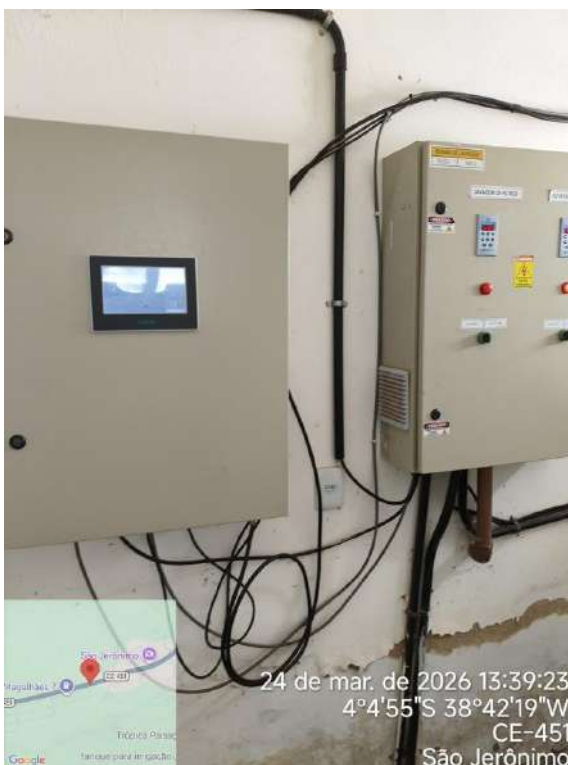
Foto 23 - ETA Dourado / Casa de Química: instalações elétricas precárias, implantadas de forma inadequada através de cobogós e sem eletrodutos de isolamento e proteção.
