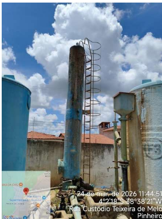
Foto 37 - ETA Guaiúba / Torre e Filtros: torre de equilíbrio e filtros com pinturas deterioradas.
