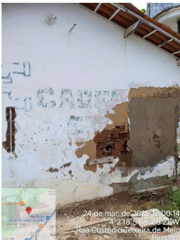
Foto 52 - ETA Guaiúba / Casa de Química: revestimentos deteriorados.
