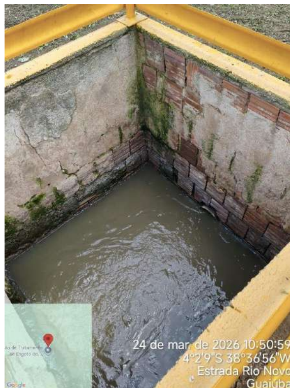
Foto 78 - ETE Guaiúba: revestimento do tratamento preliminar sem acabamento.
