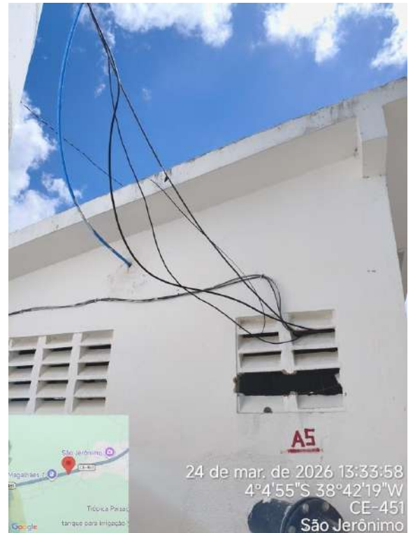
Foto 22 - ETA Dourado / Casa de Química: instalações elétricas precárias, implantadas de forma inadequada através de cobogós e sem eletrodutos de isolamento e proteção.
