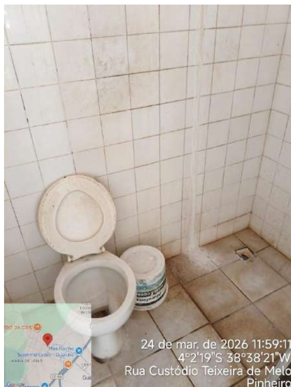
Foto 53 - ETA Guaiúba / Casa de Química: banheiro com sujeira.
