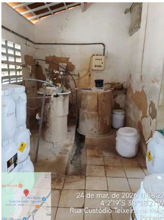
Foto 7 - ETA Guaiúba / Casa de Química: instalações improvisadas tanto no tratamento quanto nas instalações elétricas.
