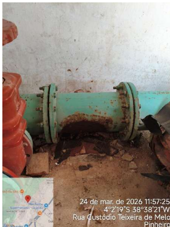
Foto 51 - ETA Guaiúba / Casa de Bombas: tubulações de água em processo de corrosão.
