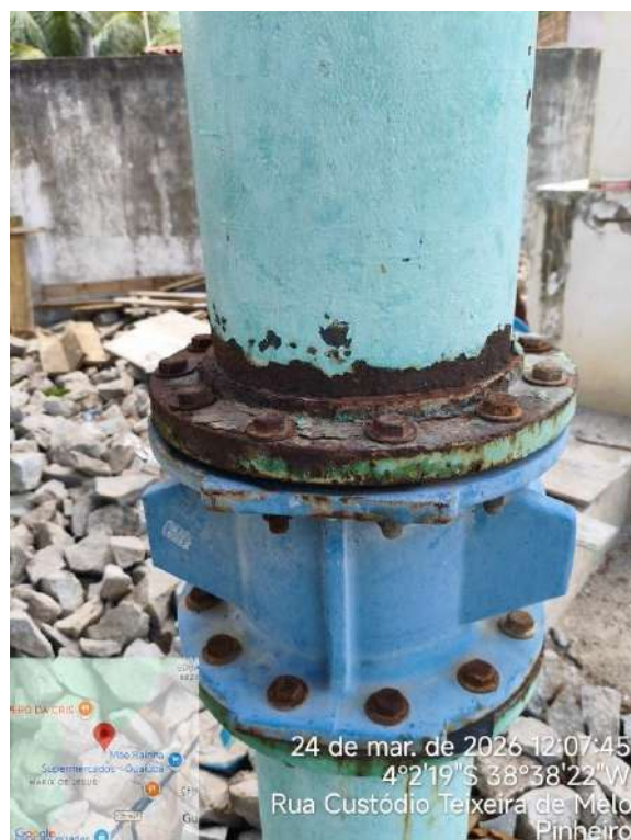
Foto 57 - ETA Guaiúba / REL-01: infraestrutura deteriorada, com tubulações em processo de corrosão.
