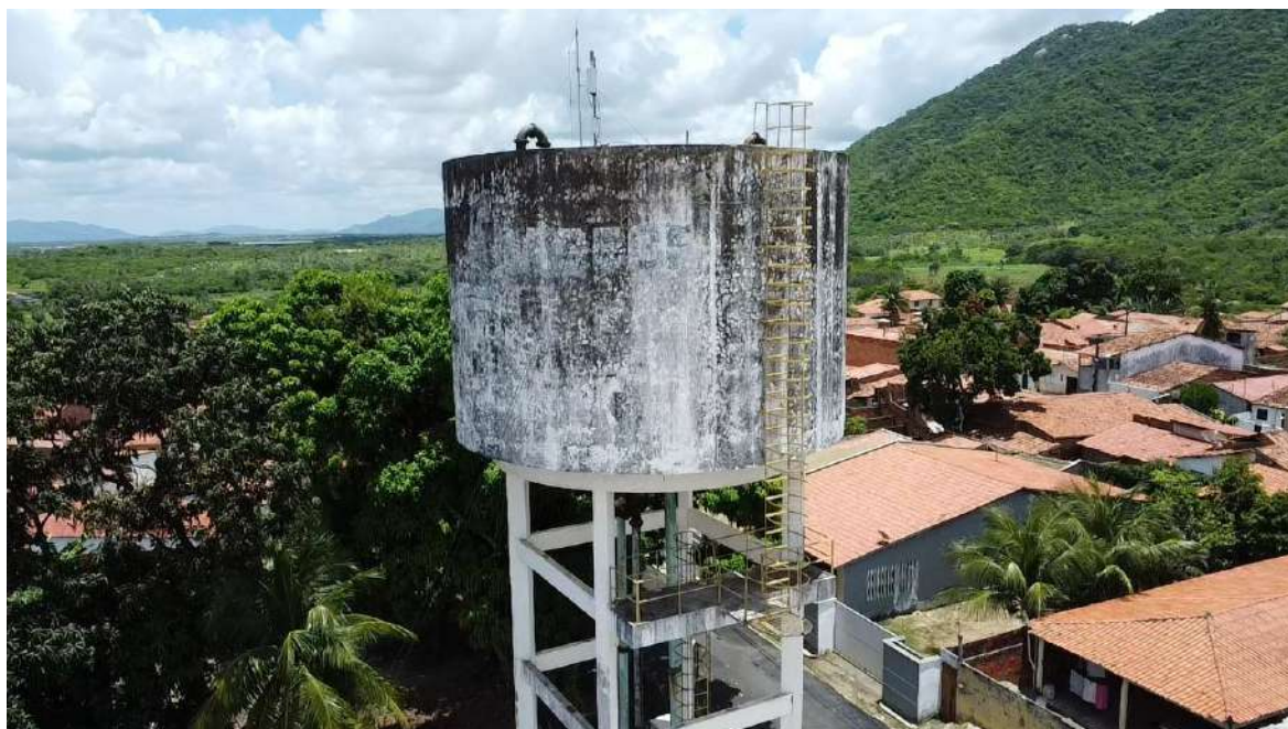
Foto 62 - ETA Guaiúba / REL-01: a pintura está deteriorada.
