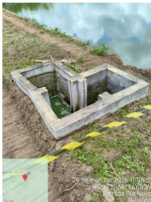
Foto 28 - ETE Guaiúba: caixa sem tampa de proteção na área de circulação.
