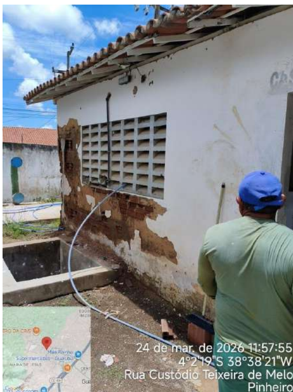
Foto 44 - ETA Guaiúba / Casa de Bombas: revestimentos deteriorados.
