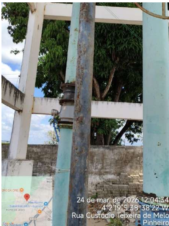
Foto 58 - ETA Guaiúba / REL-01: infraestrutura deteriorada, com tubulações em processo de corrosão.
