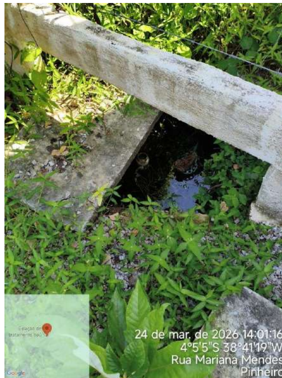
Foto 66 - Captação / Casa de Bombas (Dourado): caixa de proteção e inspeção com tampa deslocada.
