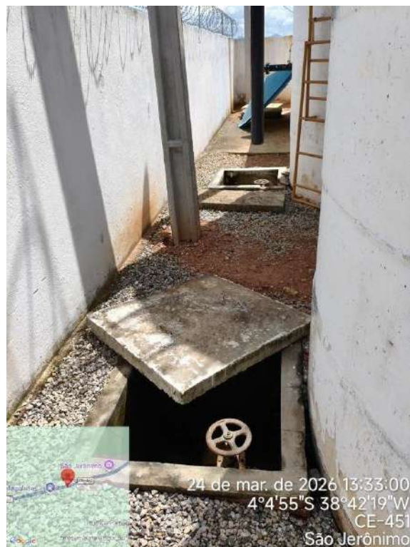
Foto 73 - ETA Dourado: caixa de inspeção com tampa inadequada fora do lugar.
