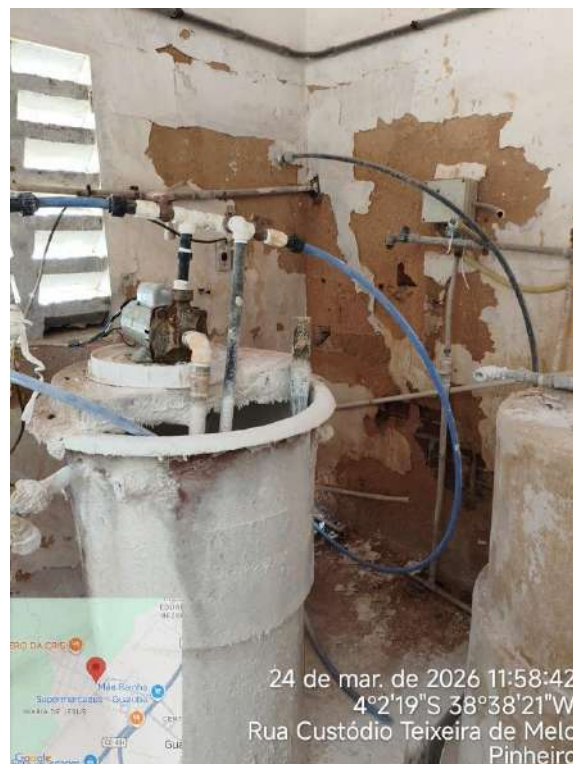
Foto 8 - ETA Guaiúba / Casa de Química: instalações improvisadas tanto no tratamento quanto nas instalações elétricas.
