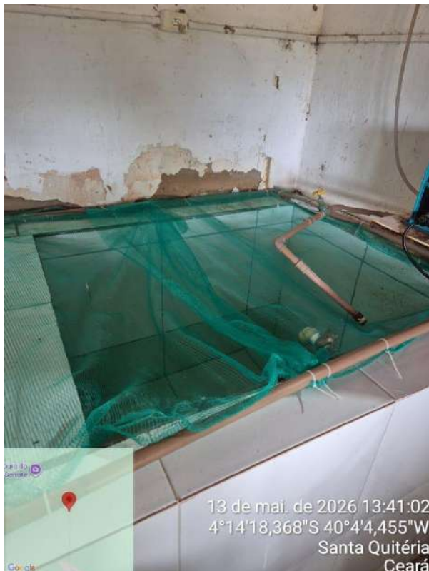
Foto 71 - ETA / Casa de química (sede): paredes desgastadas.
