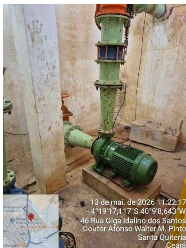
Foto 78 - EEAT-02 (sede): manchas de produto nas paredes e escada.
