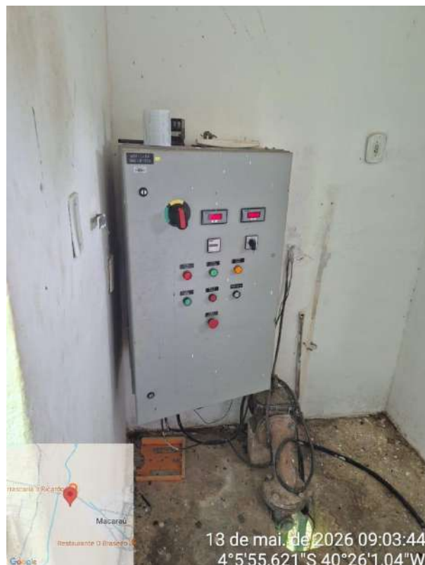
Foto 31 - PT-03 (Macaraú): fiação sem eletrodutos.
