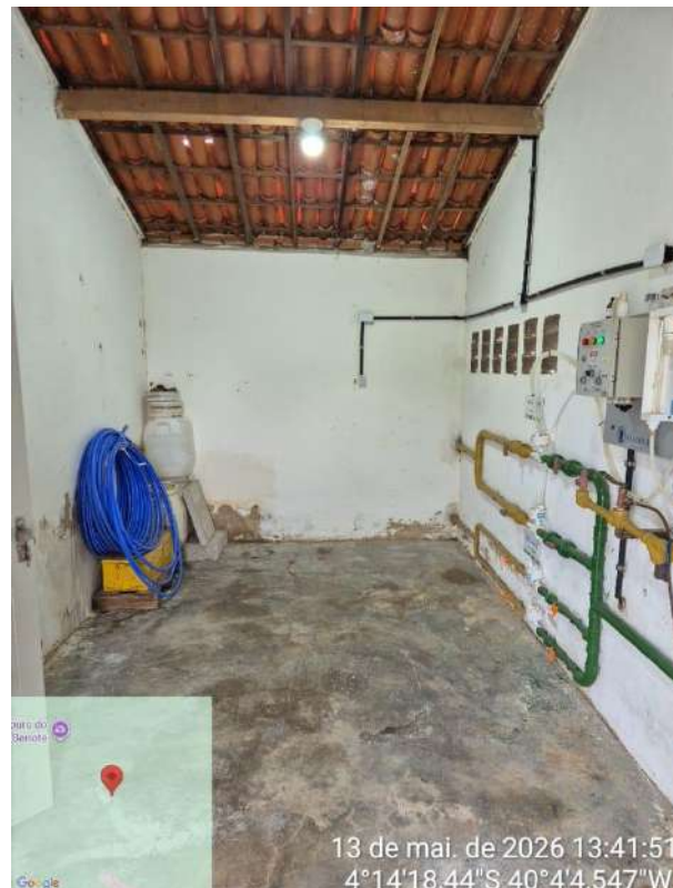
Foto 72 - ETA / Casa de química (sede): paredes desgastadas, piso no cimento.
