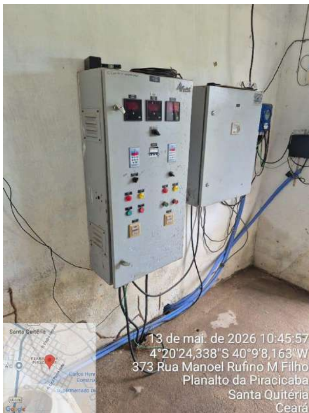
Foto 19 - EERD-02 (sede): fiação sem eletrodutos.
