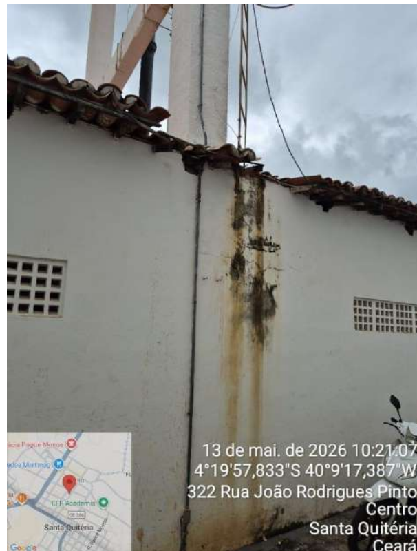
Foto 91 - EEAT-03 (sede): parede desgastada.
