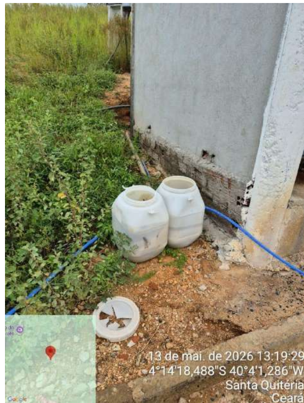
Foto 44 - Captação (sede): bombonas de produtos químicos descartados na parte externa.
