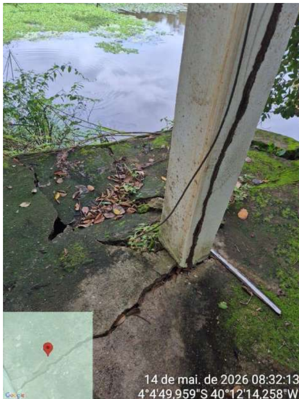
Foto 107 - EEAB-01 (Lisieux): presença de cupim e sujeira.
