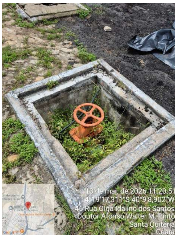
Foto 11 - EEAT-02 (sede): caixa de registro sem grade.
