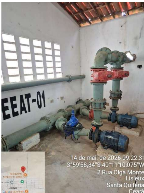
Foto 130 - ETA / EEAT-01 (Lisieux): bombas e tubulações sujas e oxidadas.
