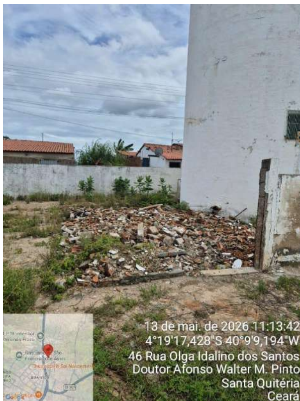
Foto 79 - REL-01 (sede): material de construção acumulado inadequadamente.
