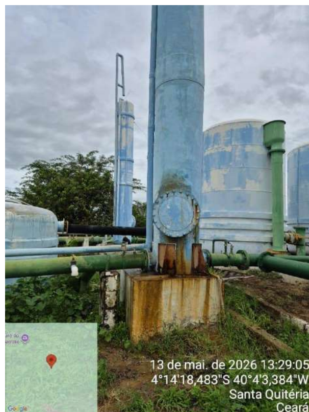
Foto 50 - ETA Santa Quitéria: torre de nível com vazamento, estrutura oxidada.
