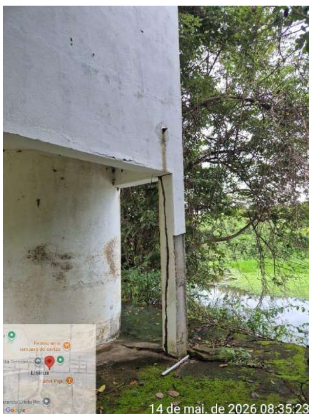
Foto 109 - EEAB-01 (Lisieux): estrutura comprometida, com rachaduras nos pilares e presença de cupim.
