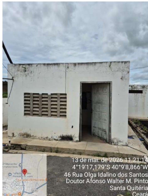
Foto 76 - EEAT-02 (sede): pintura desgastada.
