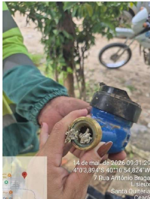
Foto 104 - EEAB-01 (Lisieux): obstrução do hidrômetro por descolamento da manta.
