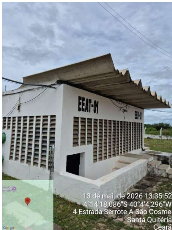
Foto 5 - EEAT-01 (sede): fiação sem eletrodutos.
