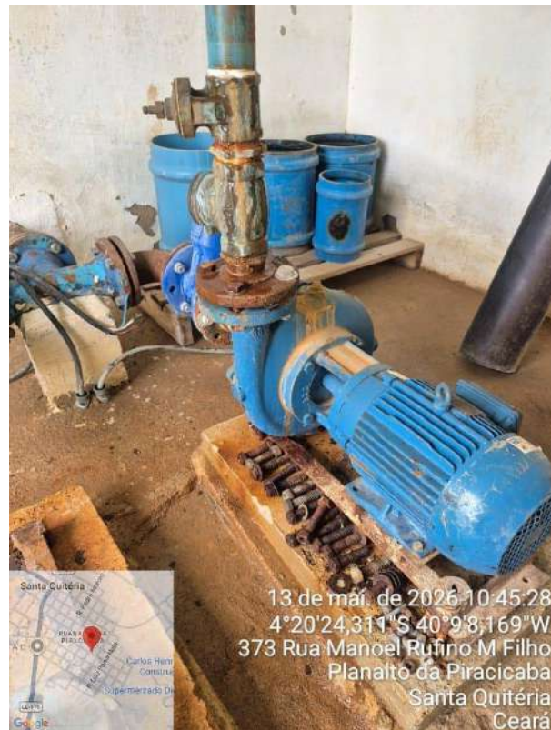
Foto 100 - tubulações e peças oxidadas, vazamento na junção.
