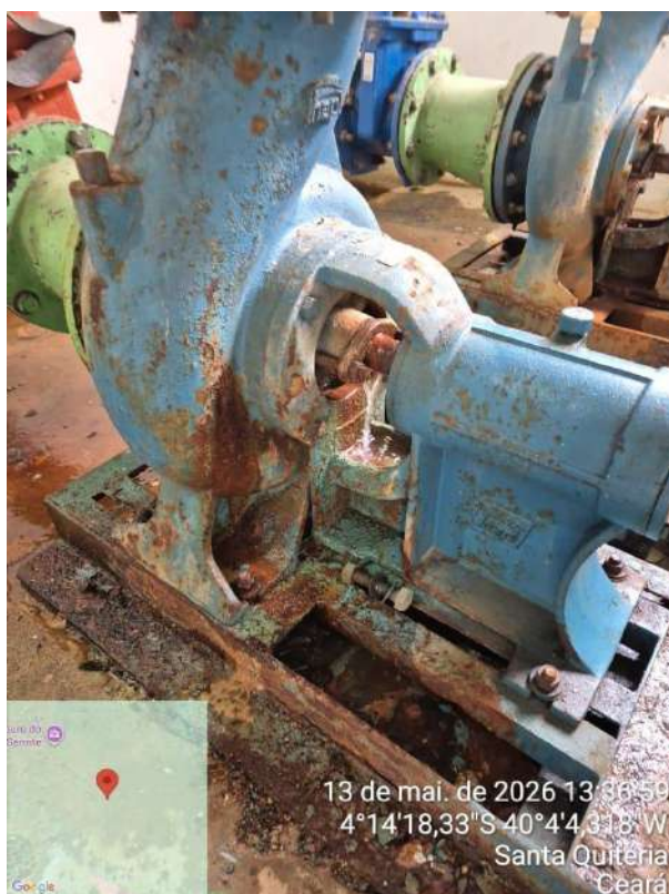
Foto 65 - ETA / Casa de bombas (sede): bomba com vazamento.
