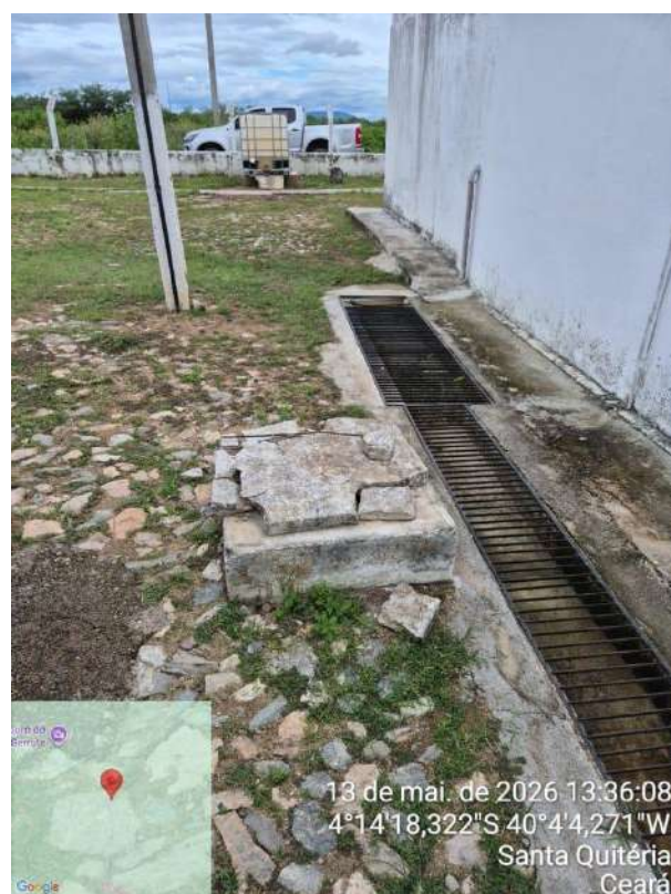
Foto 58 - ETA Santa Quitéria: tampa quebrada.
