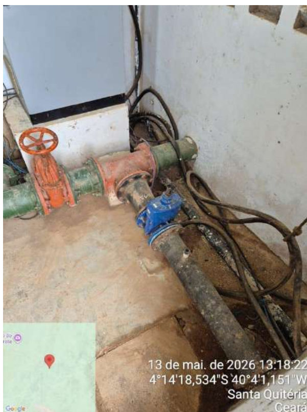
Foto 3 - Captação (sede): bombas e painéis com fiação sem eletrodutos.
