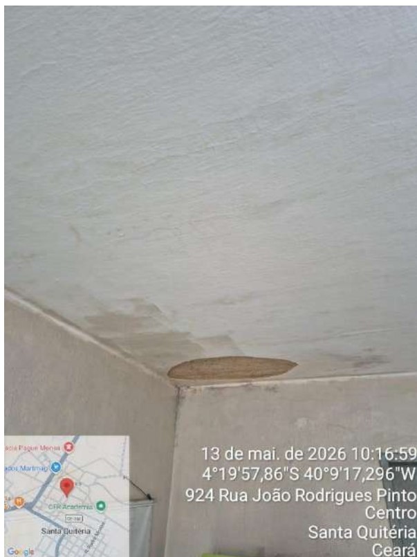
Foto 39 - Loja (sede): teto danificado.
