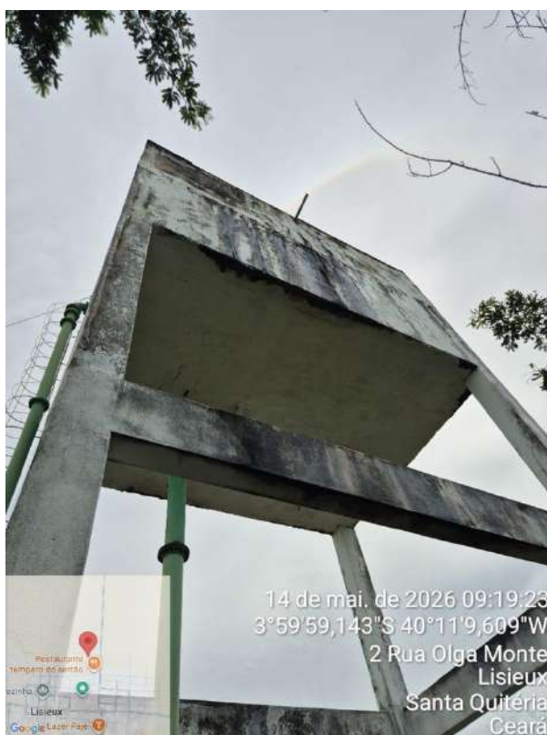
Foto 113 - ETA / REL-01 (Lisieux): rachaduras e vazamento no REL, pintura desgastada, manta de impermeabilização soltando.
