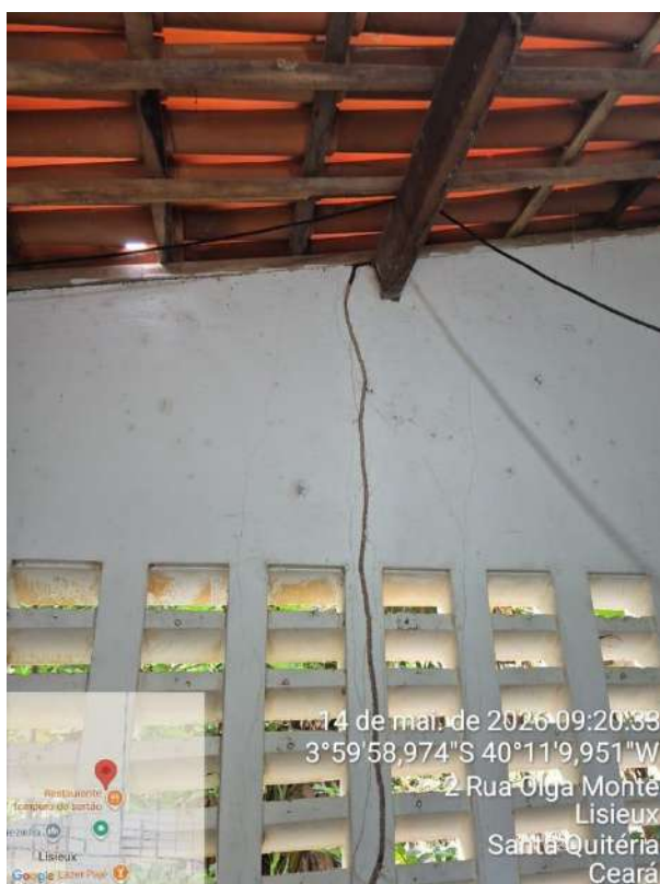
Foto 124 - ETA / Casa de química (Lisieux): presença de cupim.
