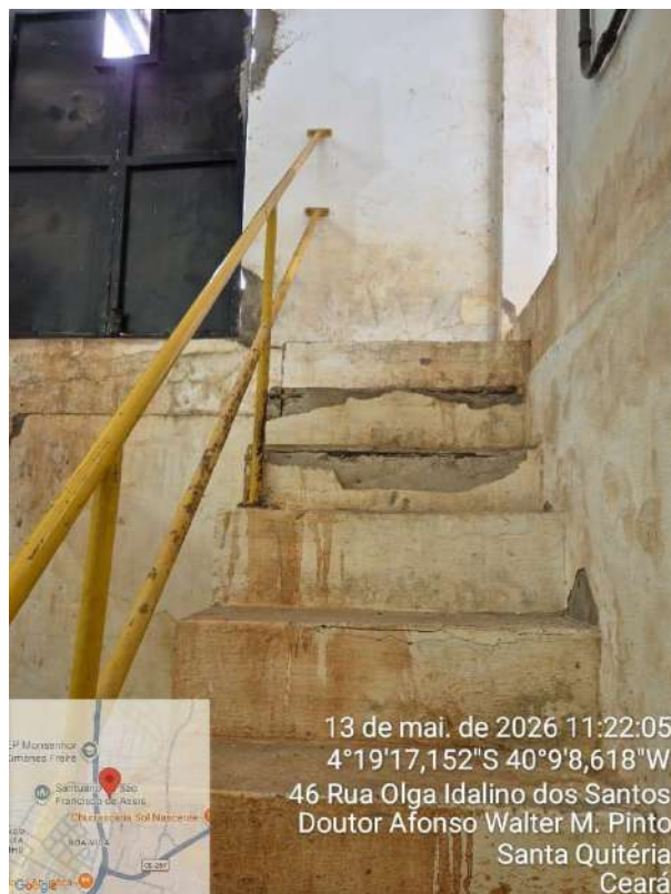
Foto 10 - EEAT-02 (sede): escada com armadura exposta.
