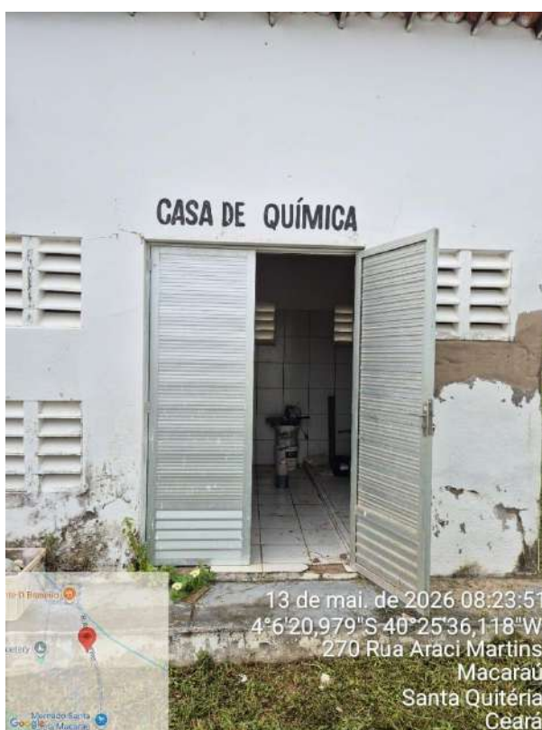
Foto 150 - ETA / Casa de química (Macaraú): parede externa desgastada.
