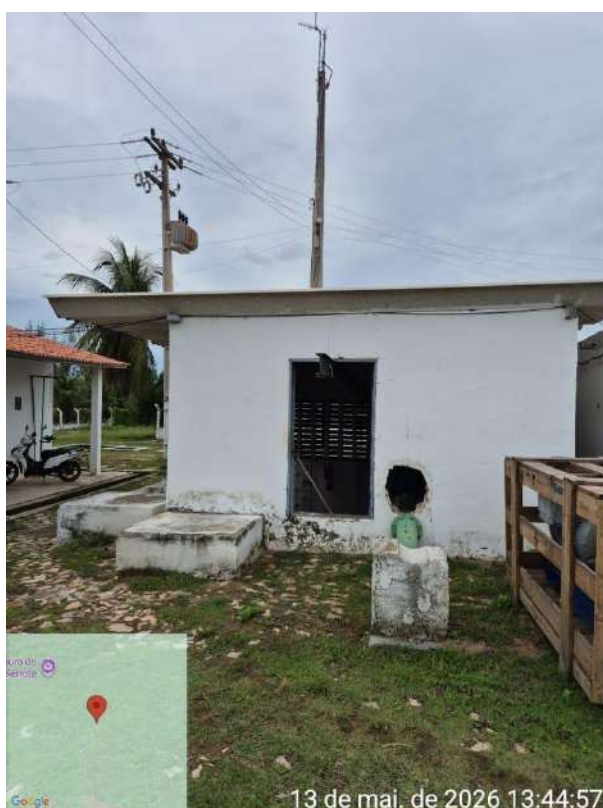
Foto 69 - ETA / Casa de bombas ( sede ): parede quebrada para passagem de tubulação.
