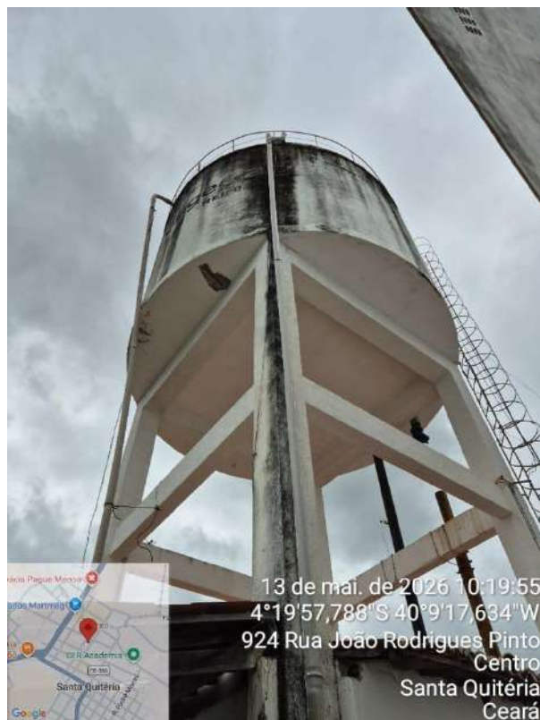
Foto 17 - REL-02 (sede): armadura exposta.
