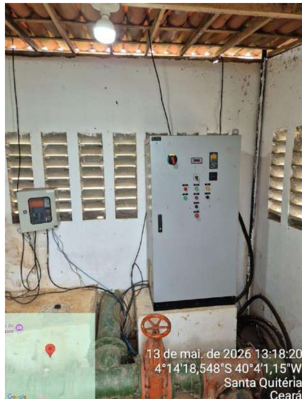
Foto 2 - Captação (sede): bombas e painéis com fiação sem eletrodutos.
