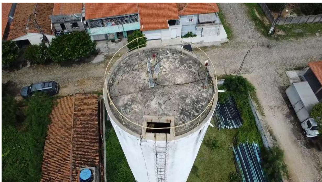
Foto 18 - REL-03 (sede): sem tampa, fiação sem eletrodutos.
