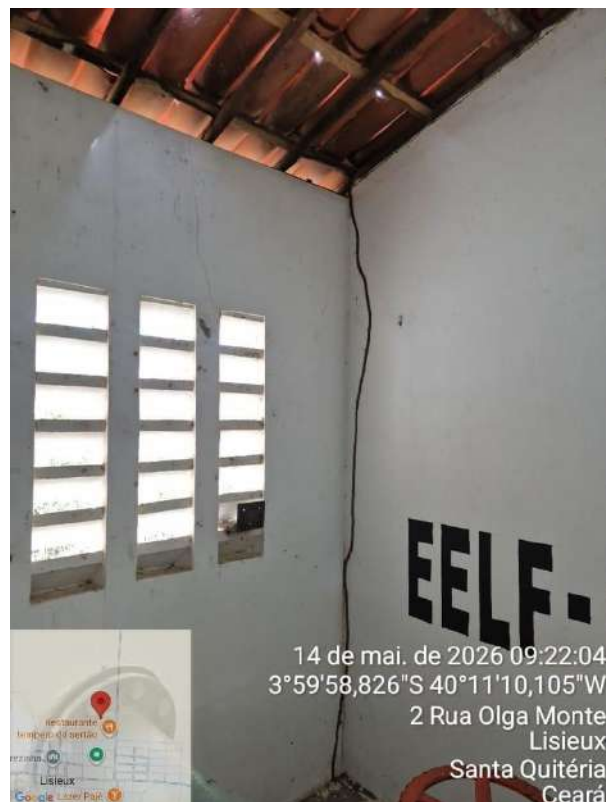
Foto 131 - ETA / EEAT-01 (Lisieux): presença de cupim.
