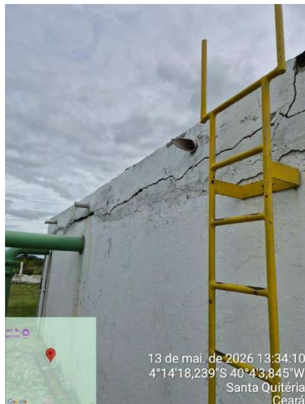
Foto 60 - ETA / RAP-01 ( sede ): presença de rachaduras, escada sem corrimão.
