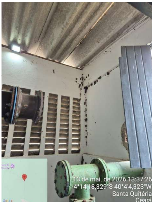
Foto 67 - ETA / Casa de bombas ( sede ): paredes com sujeira.
