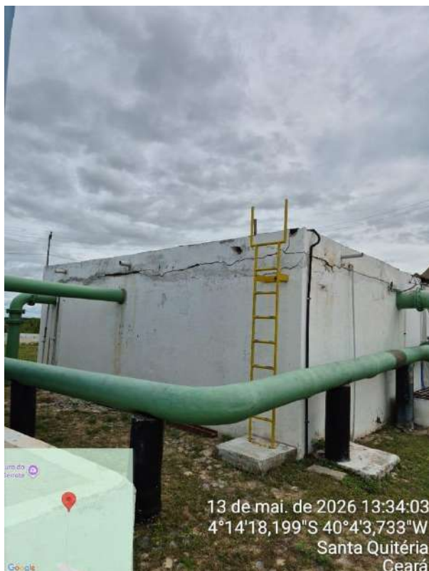
Foto 59 - ETA / RAP-01 ( sede ): pintura desgastada, presença de rachaduras.
