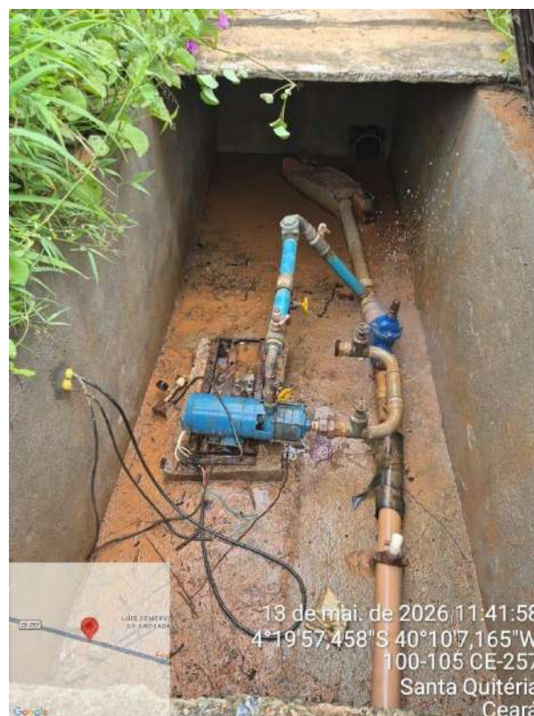
Foto 15 - EERD-01 (sede): fiação exposta sem eletrodutos.
