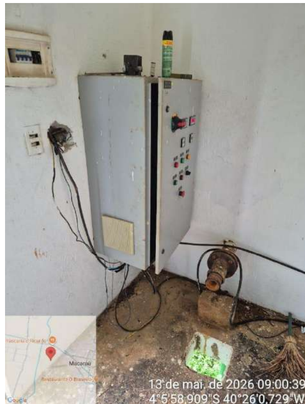
Foto 139 - PT-04 (Macaraú): casa do quadro de comando com sujeiras.
