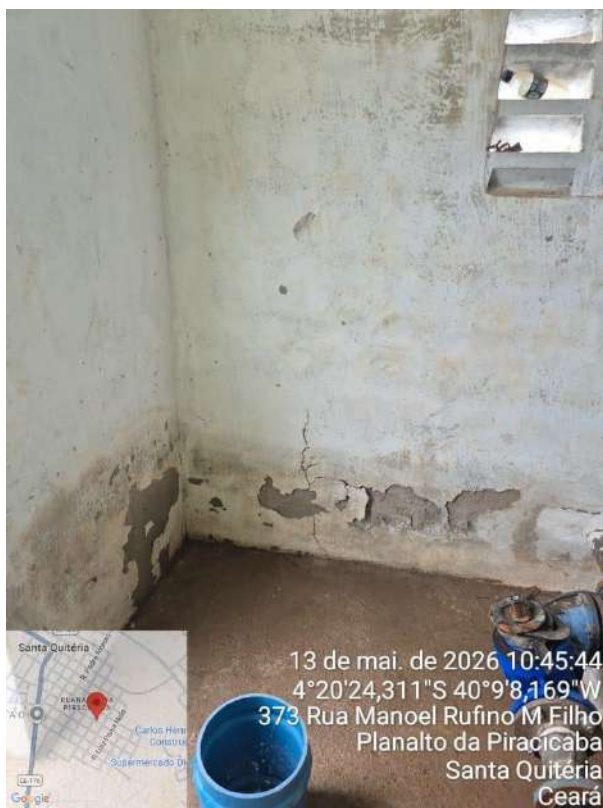
Foto 101 - EERD-02 (sede): paredes com pintura deteriorada e defeitos estruturais.
