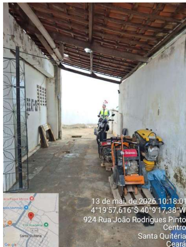
Foto 40 - Loja (sede): telhado da área externa danificado.
