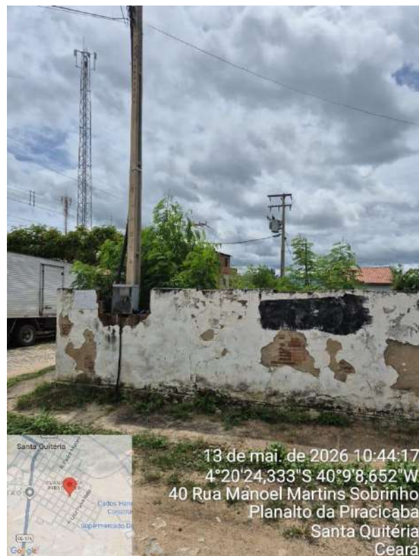
Foto 96 - EERD-02 (sede): portão e muro danificados, com diversos problemas estruturais.
