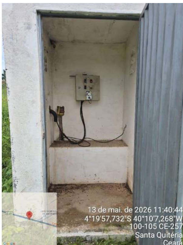
Foto 14 - EERD-01 (sede): fiação exposta sem eletrodutos, sem iluminação.
