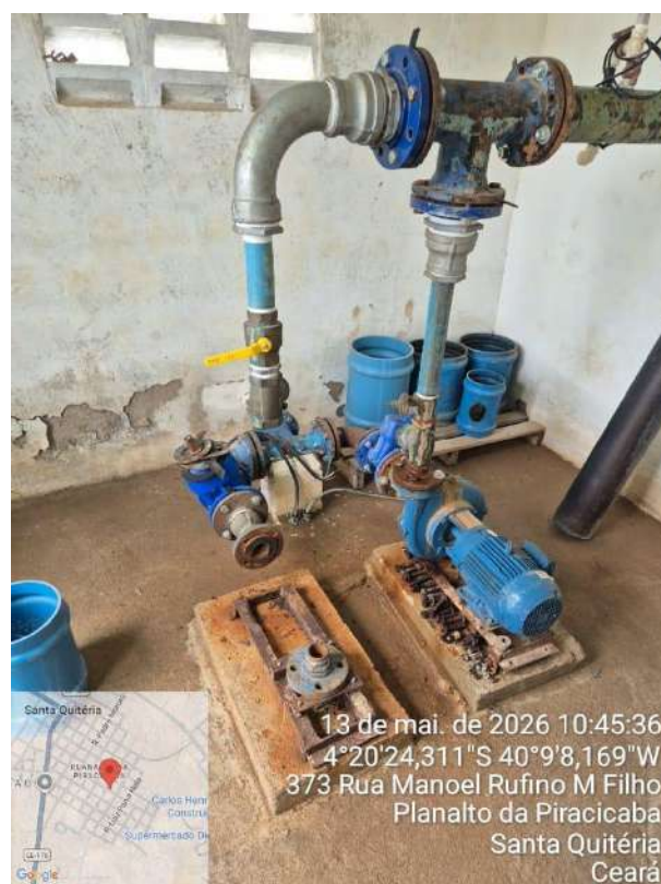
Foto 22 - EERD-02 (sede): ausência de bomba reserva.
