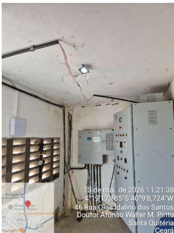
Foto 7 - EEAT-02 (sede): fiação inadequada e sem eletrodutos.
