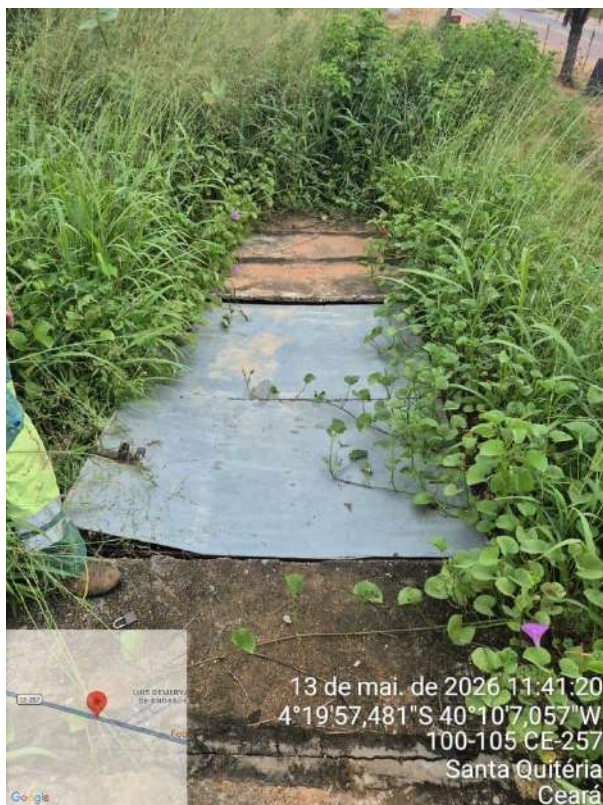
Foto 86 - EERD-01 (sede): tampa danificada.
