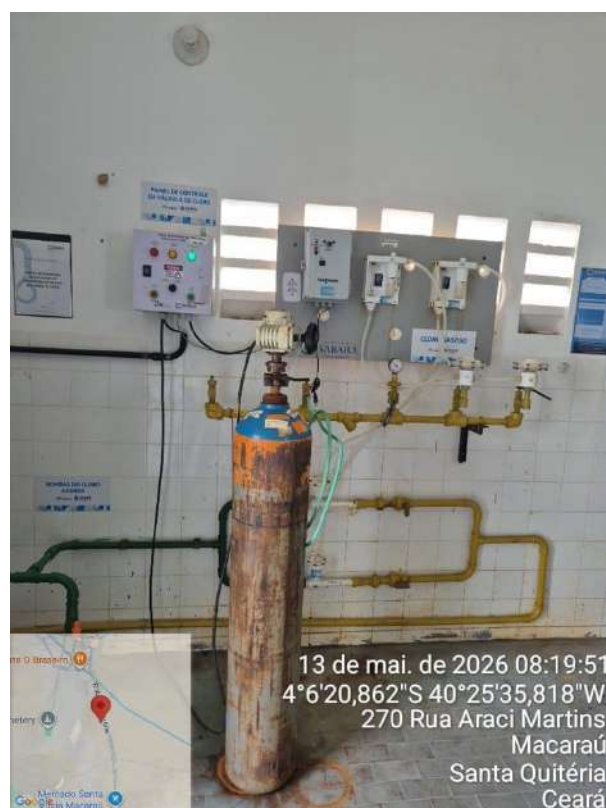
Foto 34 - ETA Macaraú: fiação sem eletrodutos.
