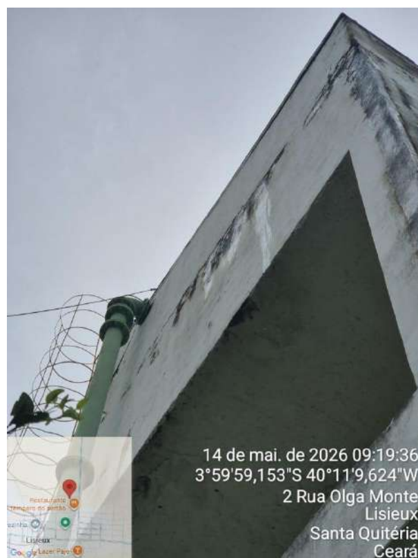
Foto 114 - ETA / REL-01 (Lisieux): rachaduras e vazamento no REL, pintura desgastada, manta de impermeabilização soltando.
