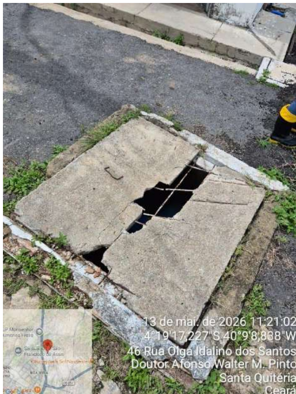
Foto 75 - EEAT-02 (sede): tampa de registro danificada.
