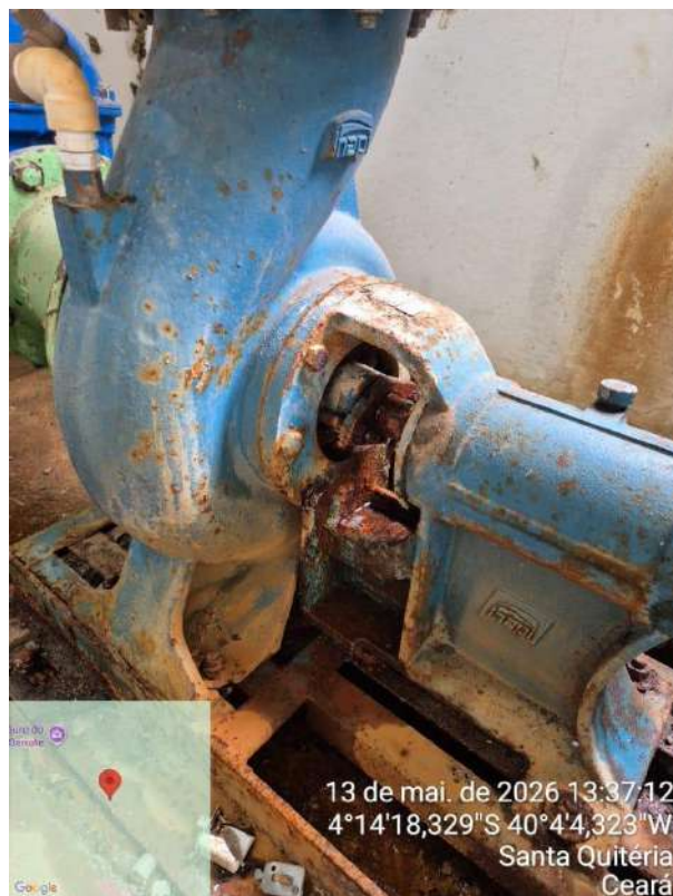
Foto 64 - ETA / Casa de bombas (sede): bomba oxidada.
