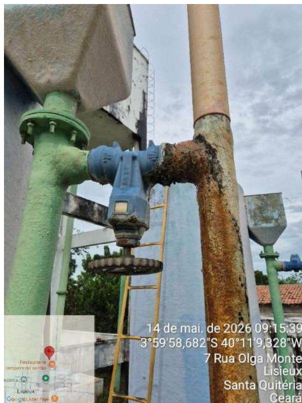
Foto 123 - ETA / Filtros (Lisieux): tubulação do F-02 com vazamento.
