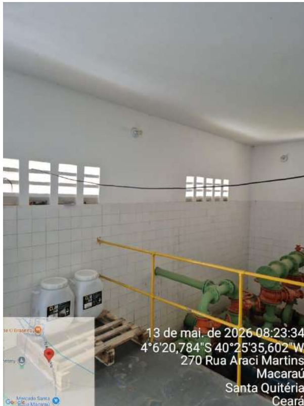
Foto 35 - ETA Macaraú: fiação sem eletrodutos.
