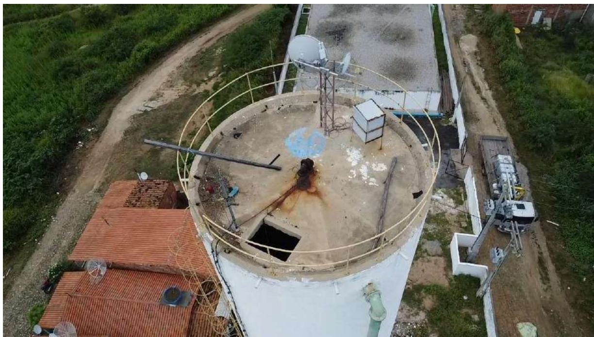
Foto 13 - REL-01 (sede): sem tampa.
