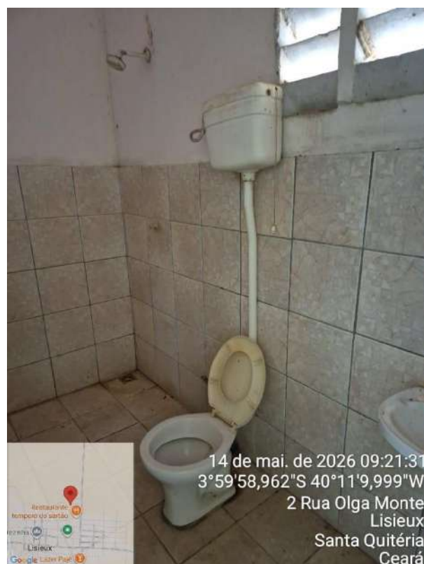
Foto 129 - ETA / Casa de química (Lisieux): banheiro com sujidades, desgastado.
