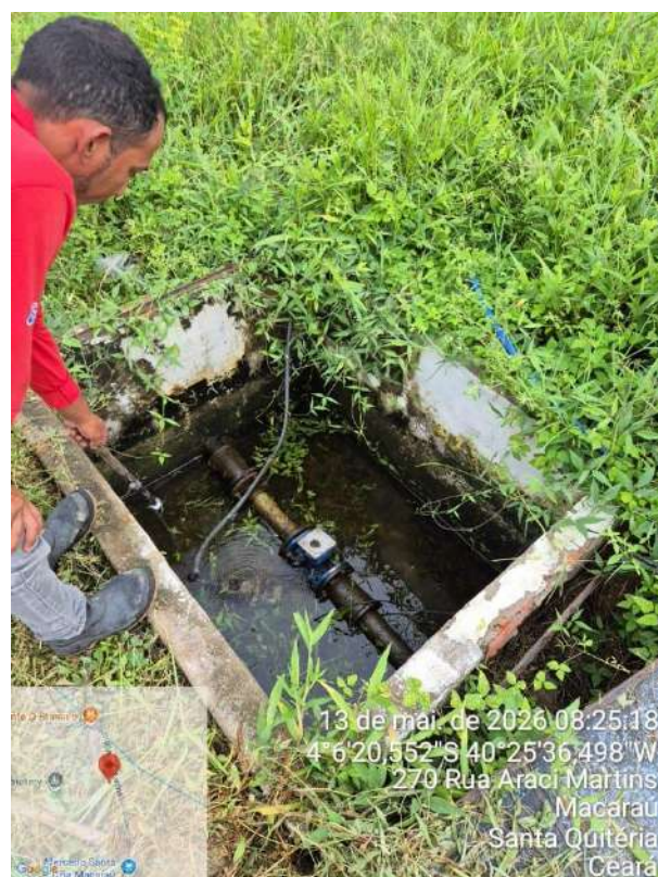
Foto 141 - ETA Macaraú: caixa de medidor sem grade de proteção, desgastada.
