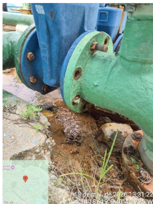
Foto 54 - ETA Santa Quitéria: F-04 com registro do filtro sem vedação, com vazamento.
