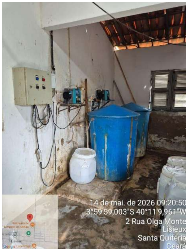
Foto 27 - ETA Lisieux: painéis com fiação sem eletrodutos.
