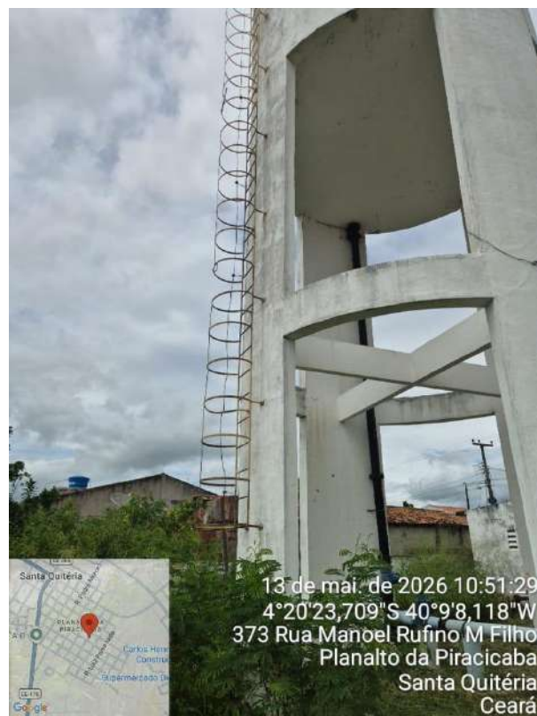
Foto 102 - REL-03 (sede): escada e guarda-corpo oxidados e com defeito.
