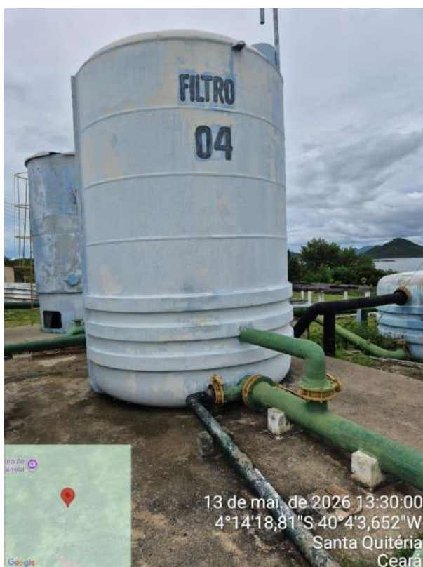
Foto 53 - ETA Santa Quitéria: F-04 com pintura e tubulação desgastada.
