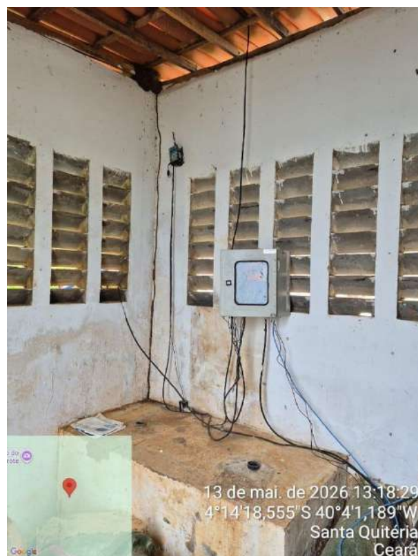
Foto 4 - Captação (sede): bombas e painéis com fiação sem eletrodutos.
