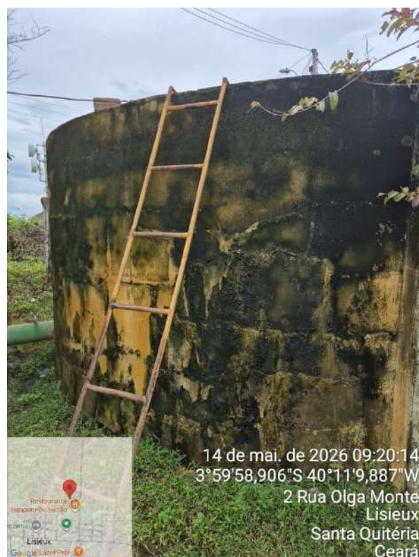
Foto 118 - ETA / RAP-01 (Lisieux): pintura muito desgastada, rachaduras na laje, com vazamento.
