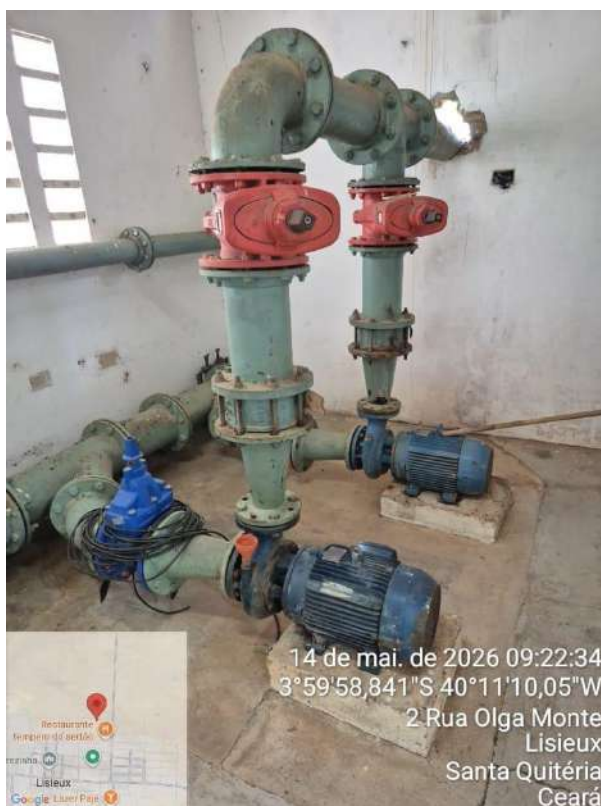
Foto 29 - ETA Lisieux: bomba com fiação sem eletrodutos presa na válvula.
