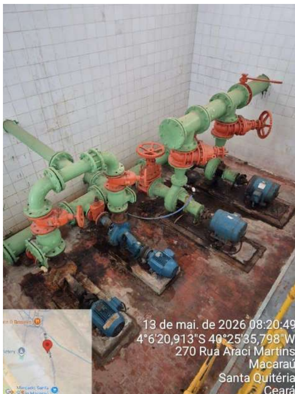
Foto 144 - ETA / Casa de bombas (Macaraú): bombas com sujeira e desgastadas.
