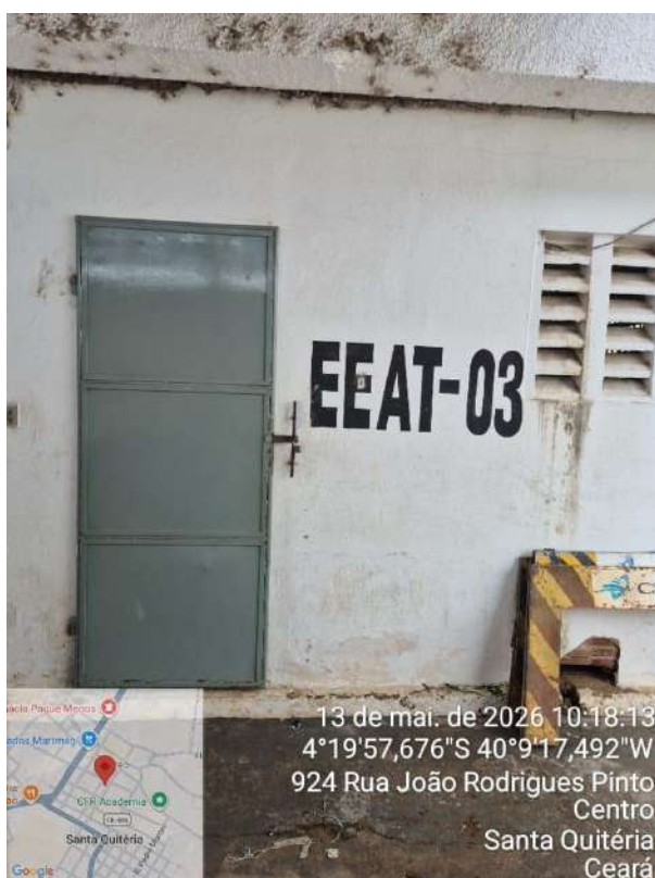
Foto 88 - EEAT-03 (sede): manchas e sujeira nas paredes.
