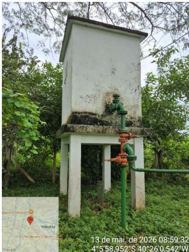
Foto 138 - PT-04 (Macaraú): pintura da casa de comando desgastada.
