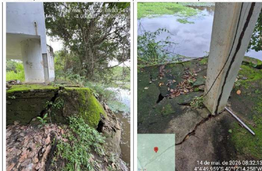
Fotos 1 e 2 – Colapso estrutural da base de apoio da captação do SAA.
