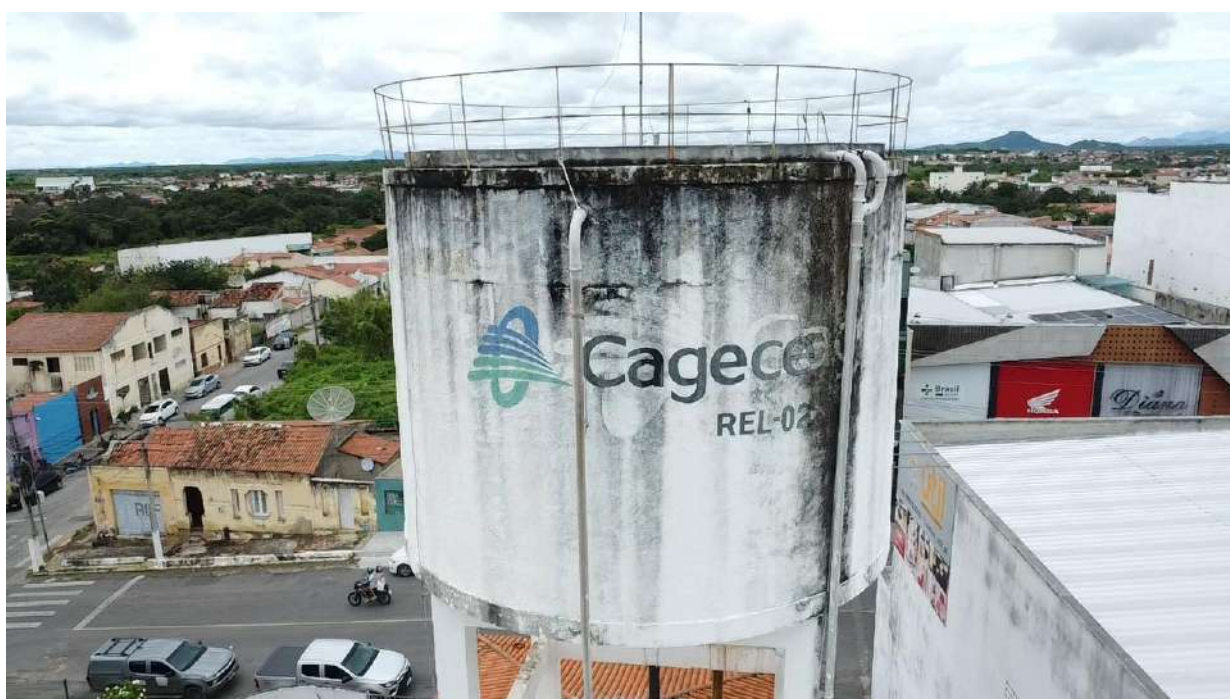
Foto 92 - REL-02 (sede): pintura desgastada, com rachaduras no pilar de sustentação e na parede.
