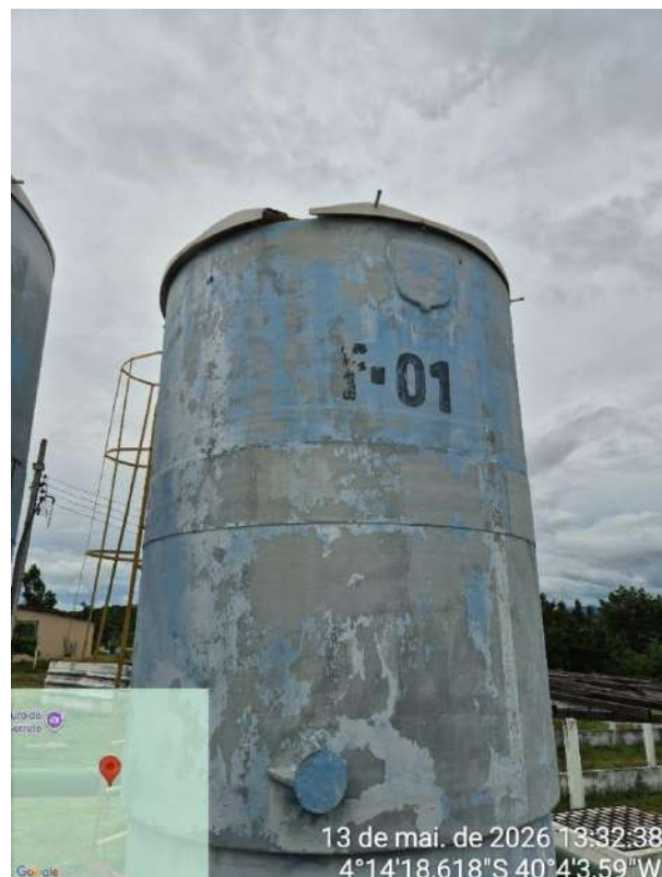
Foto 56 - ETA Santa Quitéria: F-01 com pintura desgastada.
