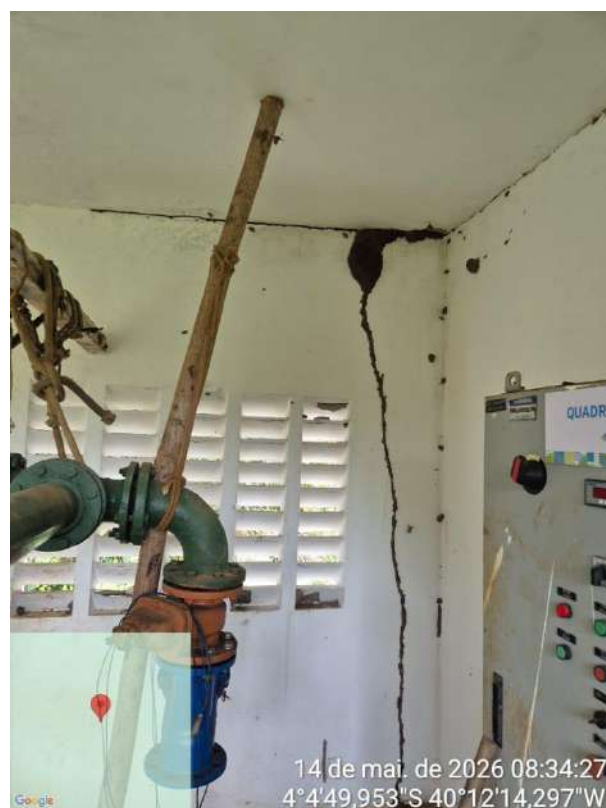
Foto 110 - EEAB-01 (Lisieux): presença de cupim; tubulação da bomba com apoio improvisado (madeira).
