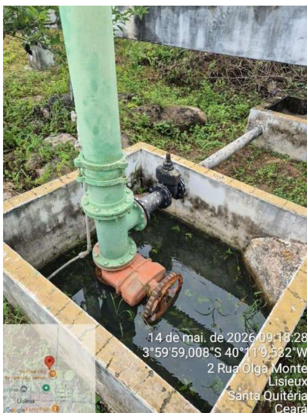
Foto 117 - ETA / REL-01 (Lisieux): caixa com manchas de infiltração, vazamento na válvula.
