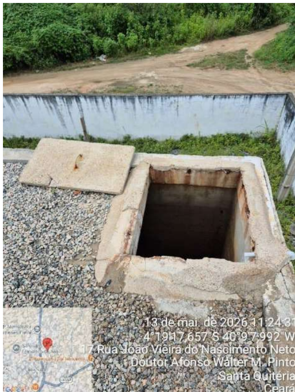
Foto 82 - RAP-03 (sede): tampa deslocada.
