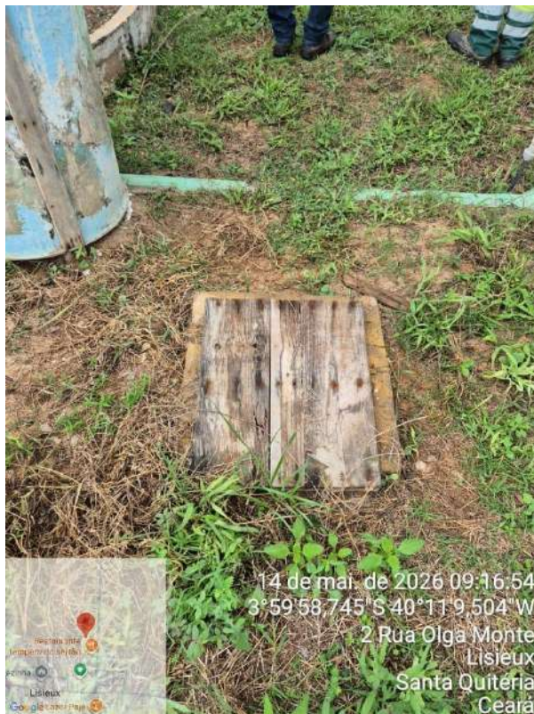
Foto 111 - ETA Lisieux: caixa com tampa de madeira improvisada.
