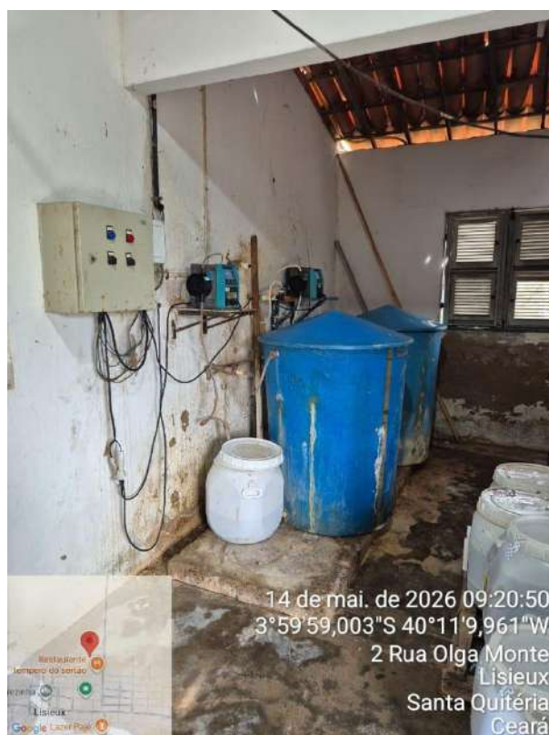
Foto 125 - ETA / Casa de química (Lisieux): piso e paredes desgastadas e com sujidades.
