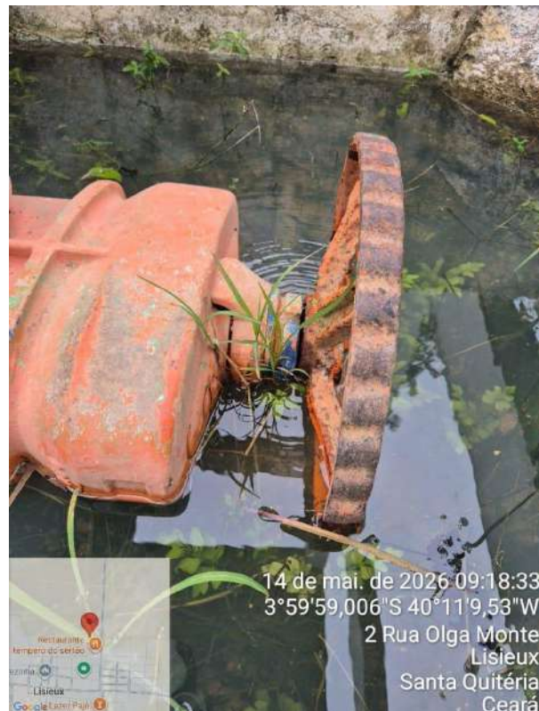
Foto 116 - ETA / REL-01 (Lisieux): vazamento no registro.
