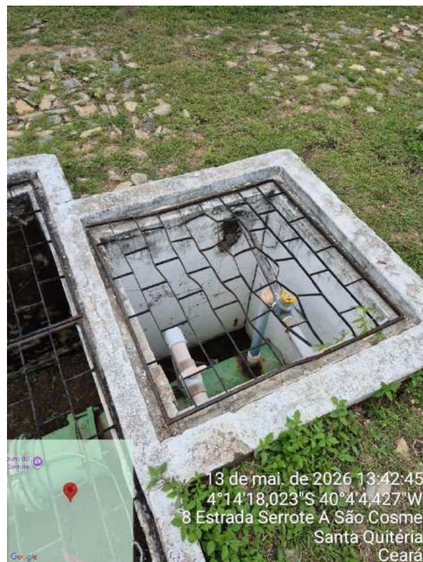
Foto 48 - ETA Santa Quitéria: registros com grades danificadas.
