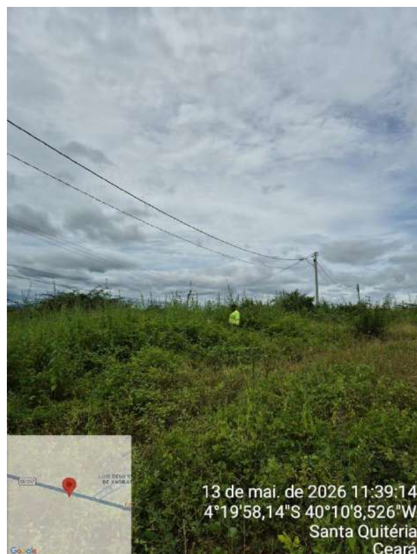
Foto 85 - EERD-01 (sede): dificuldade de acesso devido ao excesso de vegetação.
