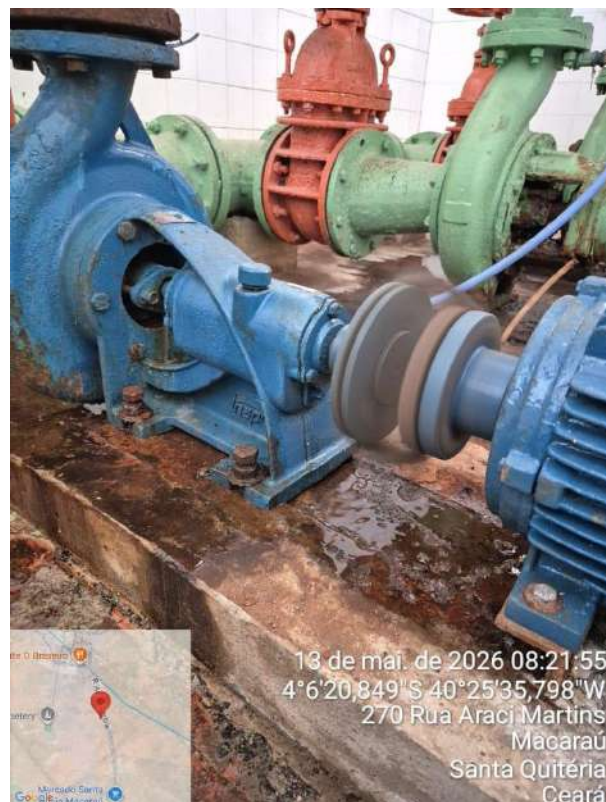
Foto 149 - ETA / Casa de bombas (Macaraú): bombas sem proteção e com vazamento.
