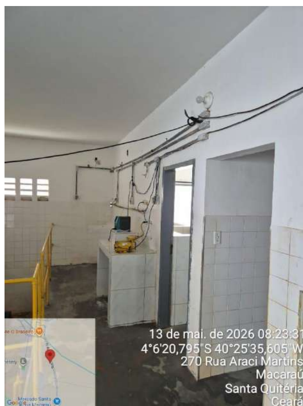
Foto 33 - ETA Macaraú: fiação sem eletrodutos.
