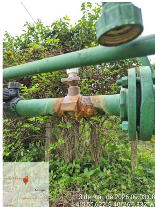
Foto 135 - PT-03 (Macaraú): vazamento no registro.
