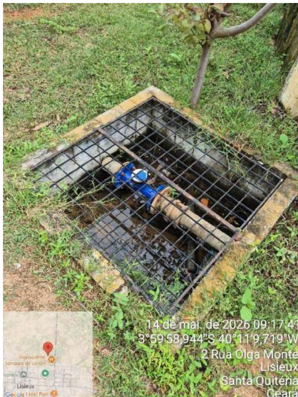
Foto 115 - ETA / REL-01 (Lisieux): caixa com acúmulo de água.
