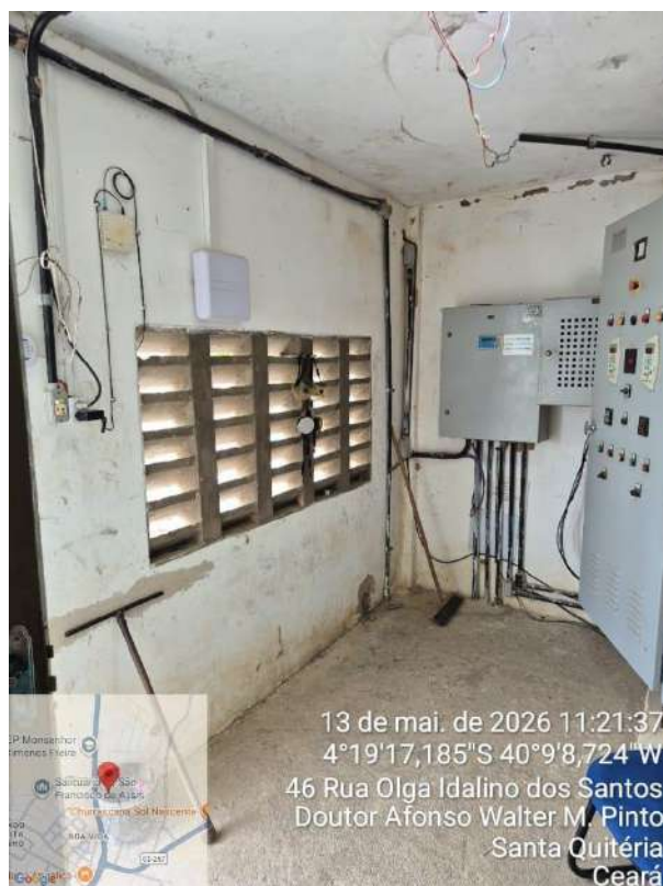
Foto 8 - EEAT-02 (sede): fiação inadequada e sem eletrodutos.
