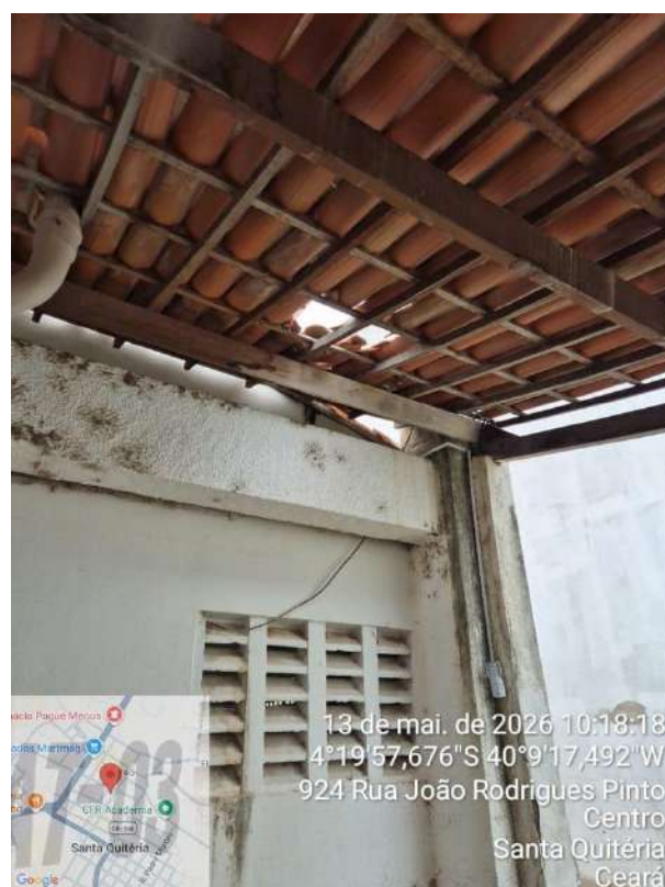
Foto 89 - EEAT-03 (sede): telhado quebrado.
