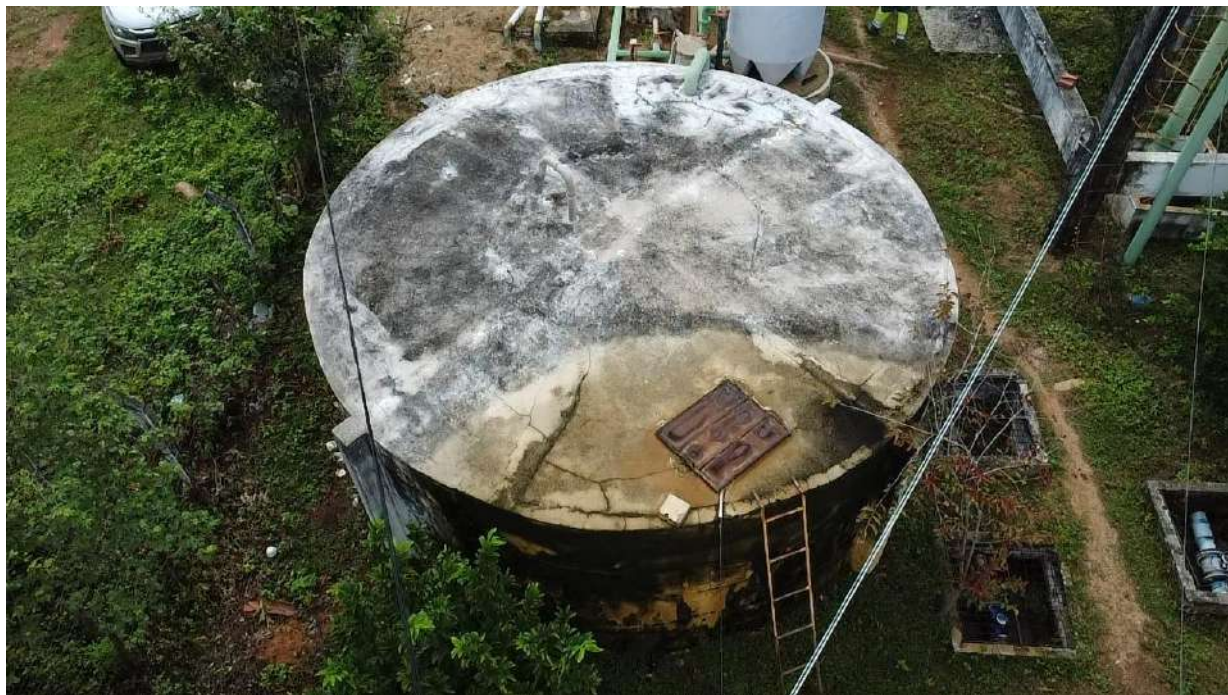
Foto 119 - ETA / RAP-01 (Lisieux): rachaduras na laje, com vazamento; tampa oxidada.
