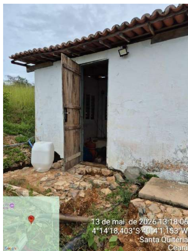
Foto 42 - Captação (sede): piso de entrada degradado, apresentando risco de acidentes.
