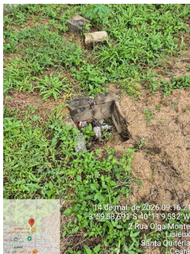
Foto 26 - ETA Lisieux: caixas sem grade de proteção.
