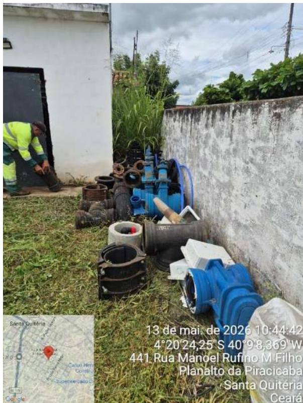
Foto 99 - EERD-02 (sede): materiais diversos armazenados no terreno, sem organização.
