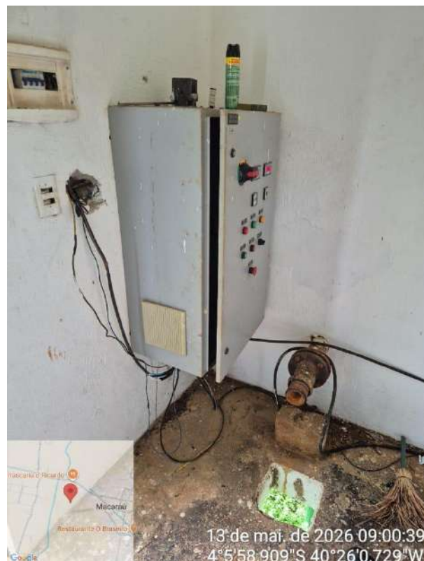
Foto 32 - PT-04 (Macaraú): fiação sem eletrodutos.
