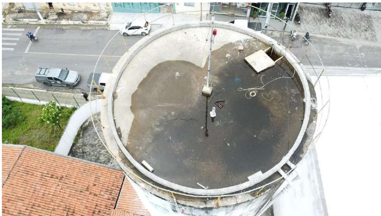
Foto 93 - REL-02 (sede): tampa deslocada, com acúmulo de água na laje.
