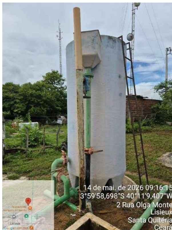
Foto 121 - ETA / Filtros (Lisieux): pintura desgastada, tubulações oxidadas.
