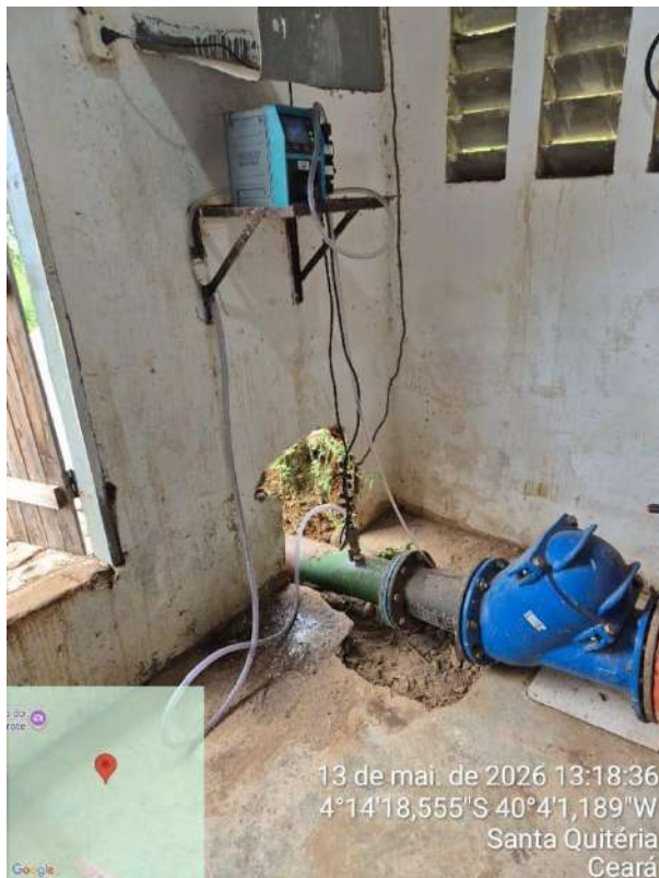
Foto 43 - Captação (sede): parede quebrada para passagem da tubulação inadequadamente.
