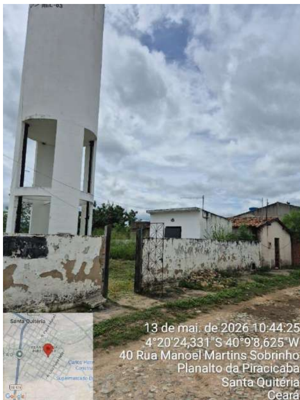
Foto 95 - EERD-02 (sede): portão e muro danificados, com diversos problemas estruturais.
