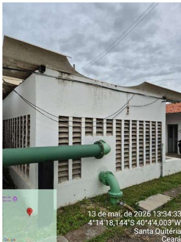
Foto 6 - EEAT-01 (sede): fiação sem eletrodutos.
