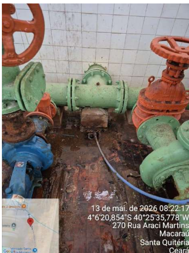
Foto 146 - ETA / Casa de bombas (Macaraú): bombas com base oxidada e com vazamento.
