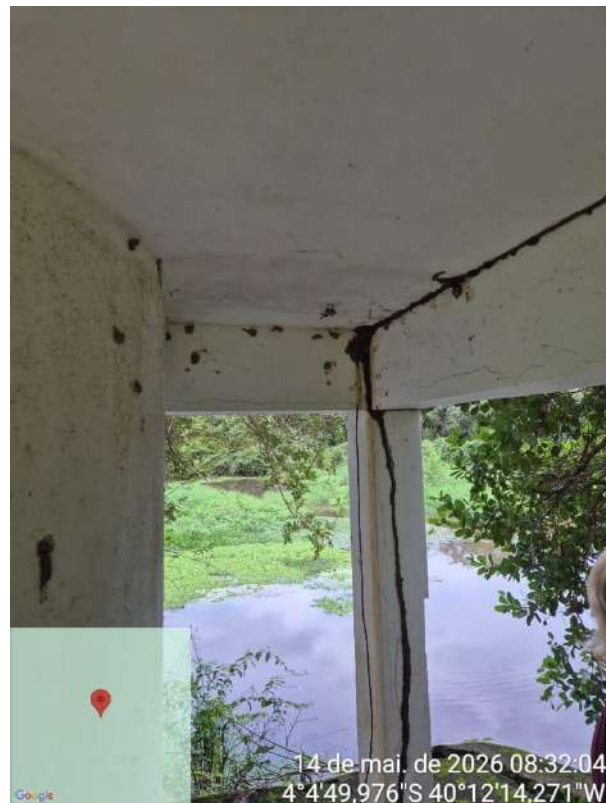
Foto 108 - EEAB-01 (Lisieux): presença de cupim e sujeira.
