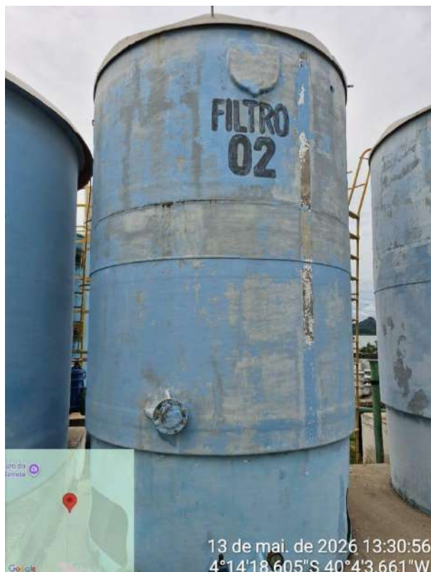
Foto 55 - ETA Santa Quitéria: F-02 com pintura desgastada.
