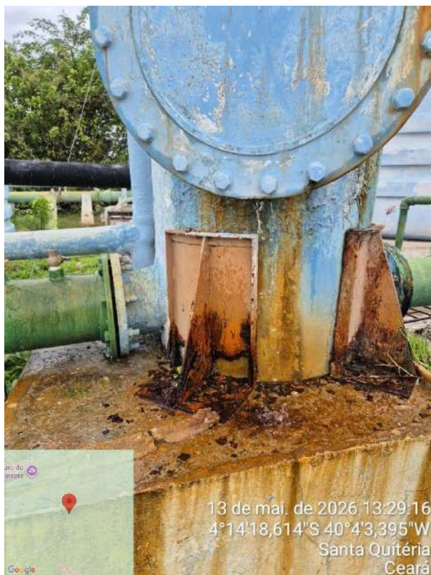
Foto 51 - ETA Santa Quitéria: torre de nível com vazamento, estrutura oxidada.
