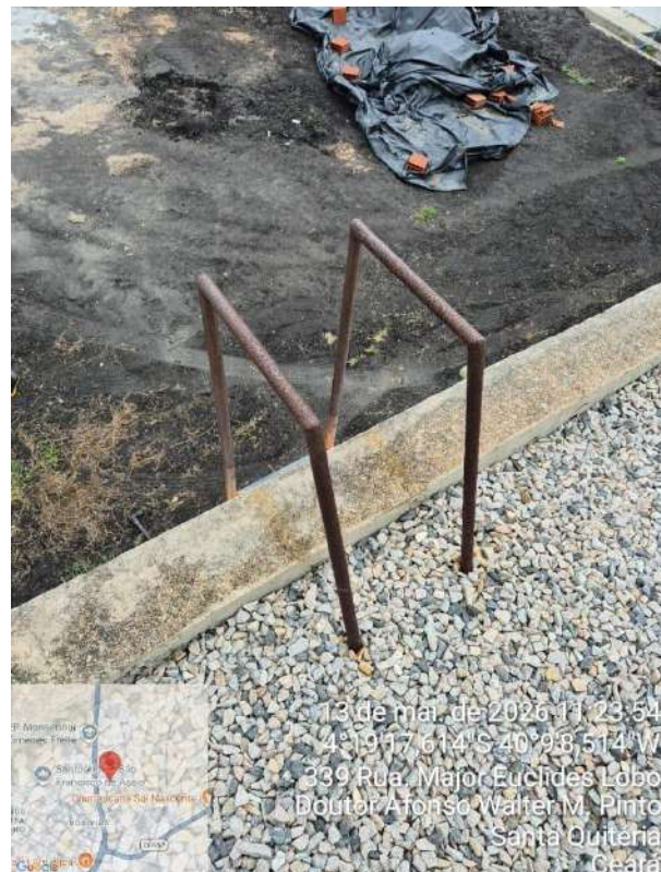
Foto 83 - RAP-03 (sede): escada oxidada.
