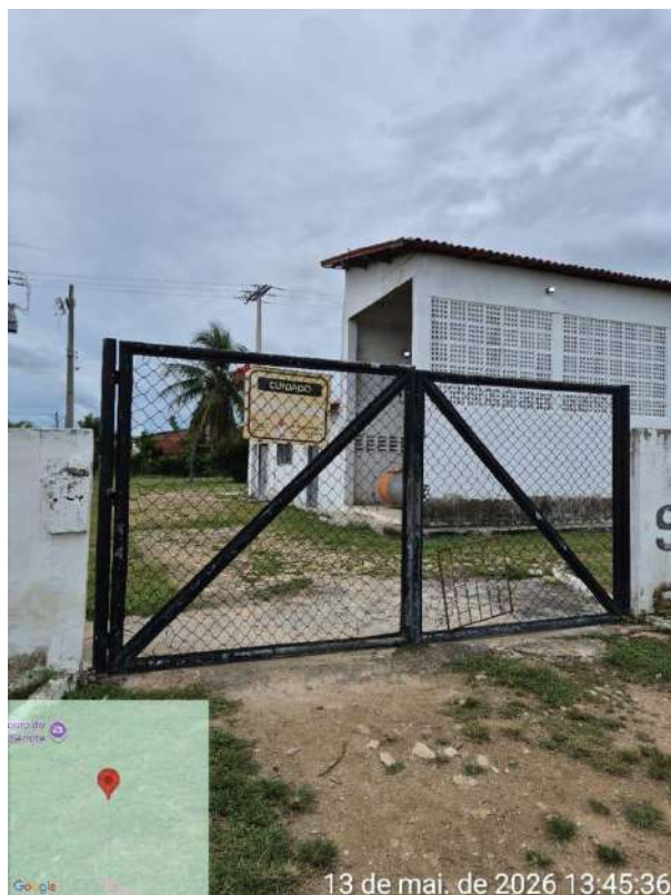
Foto 47 - ETA Santa Quitéria: portão de acesso com defeito.
