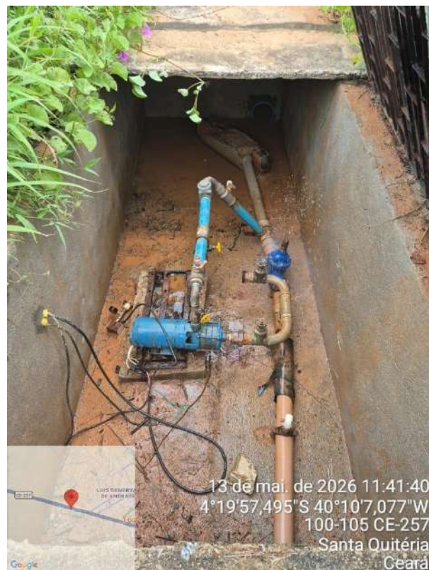
Foto 87 - EERD-01 (sede): vazamento na tubulação.
