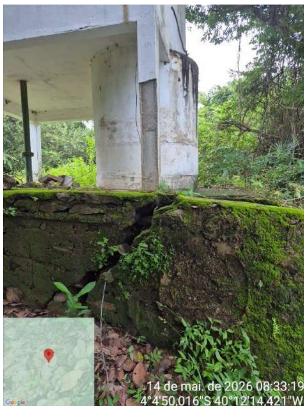
Foto 105 - EEAB-01 (Lisieux): estrutura comprometida, com rachaduras na base.
