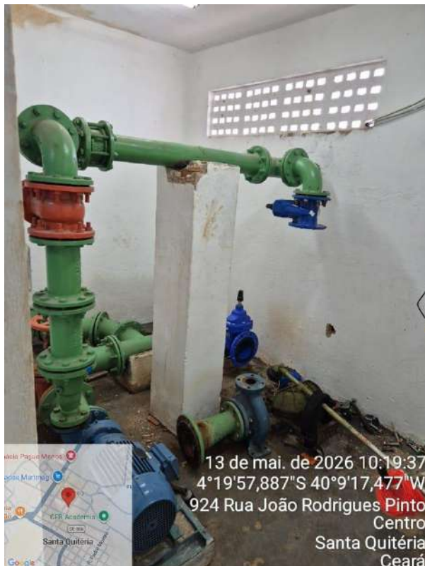
Foto 90 - EEAT-03 (sede): pilar com rachaduras, parte das bombas faltando, piso com sujidades.
