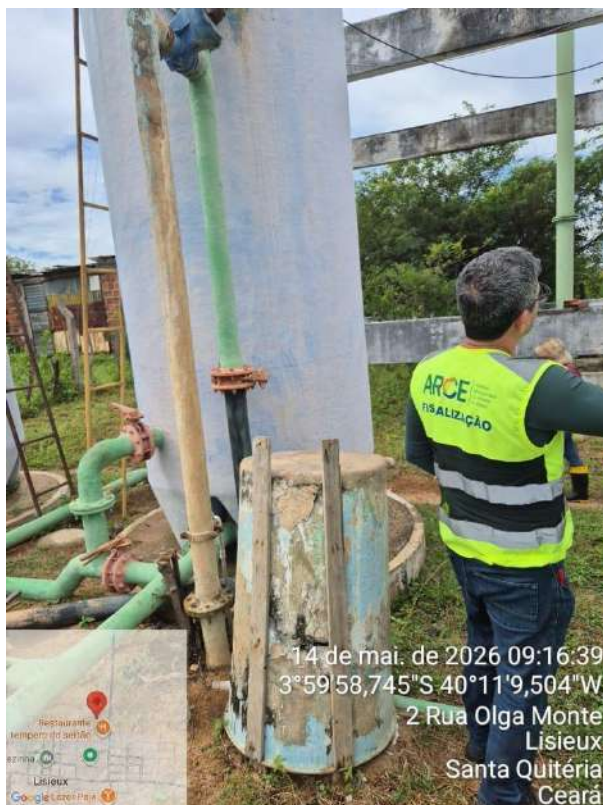
Foto 122 - ETA / Filtros (Lisieux): F-02 com apoio improvisado para manutenção.
