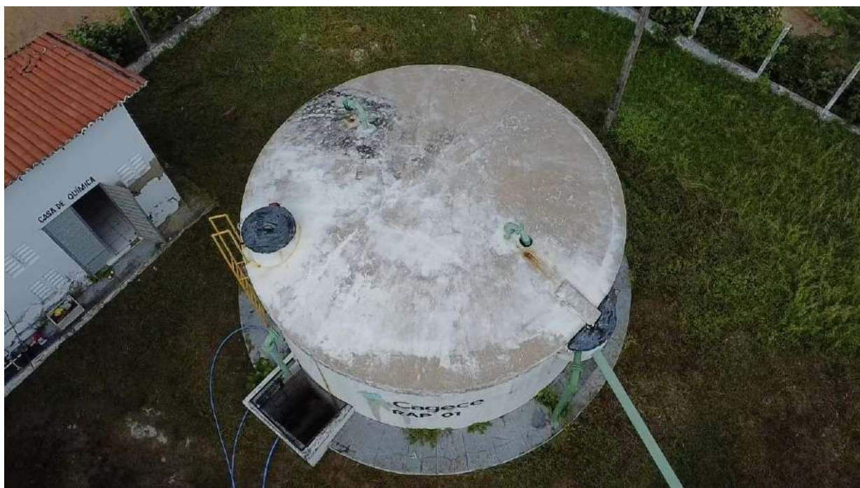
Foto 143 - ETA Macaraú: pintura do RAP-01 e tampa desgastadas.
