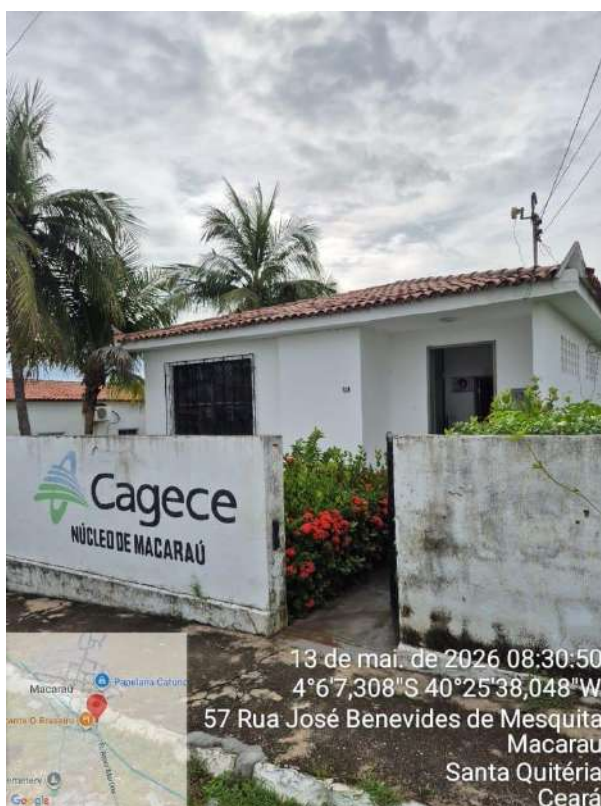
Foto 132 - Loja (Macaraú): muro com pintura desgastada.
