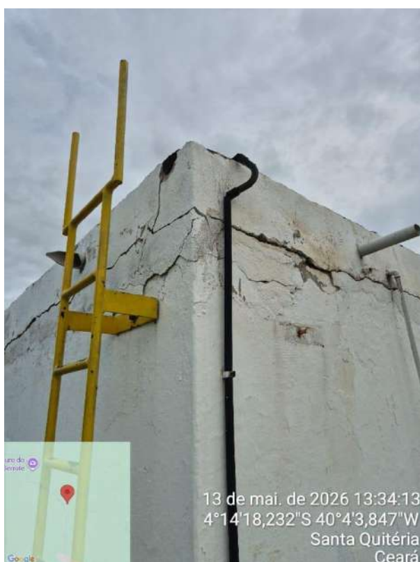
Foto 61 - ETA / RAP-01 ( sede ): presença de rachaduras.
