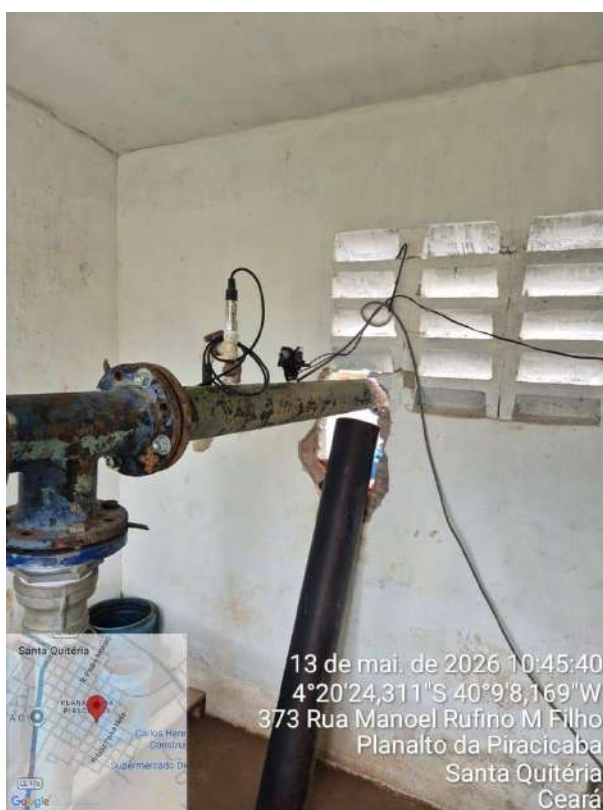
Foto 21 - EERD-02 (sede): fiação sem eletrodutos, abertura inadequada na parede.
