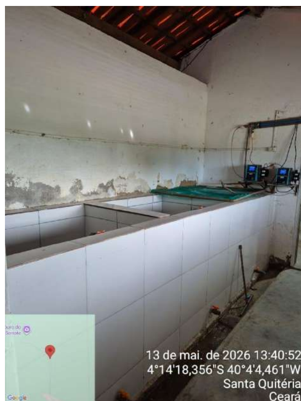
Foto 70 - ETA / Casa de química ( sede ): paredes desgastadas.
