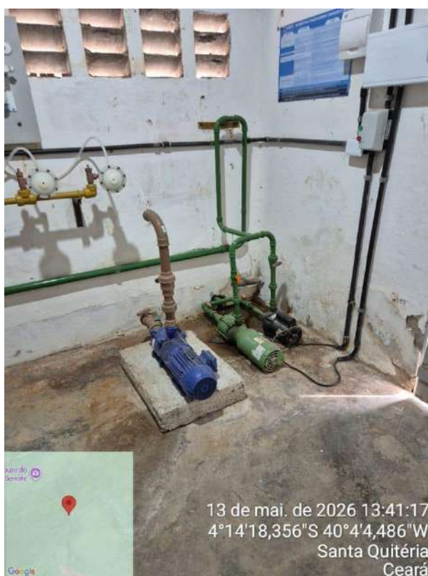
Foto 73 - ETA / Casa de química (sede): bomba sem base de apoio.
