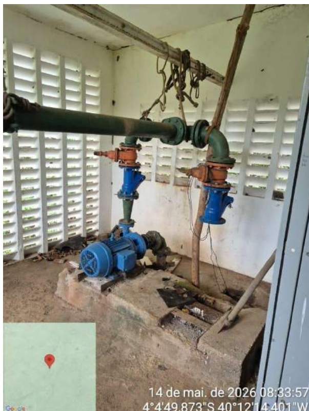
Foto 23 - EEAB-01 (Lisieux): ausência de bomba reserva.
