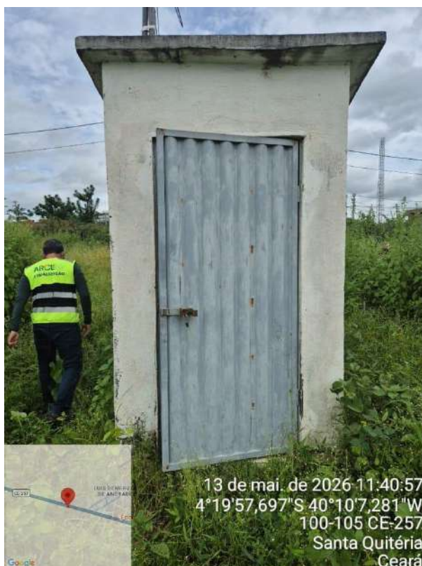
Foto 84 - EERD-01 (sede): dificuldade de acesso devido ao excesso de vegetação.
