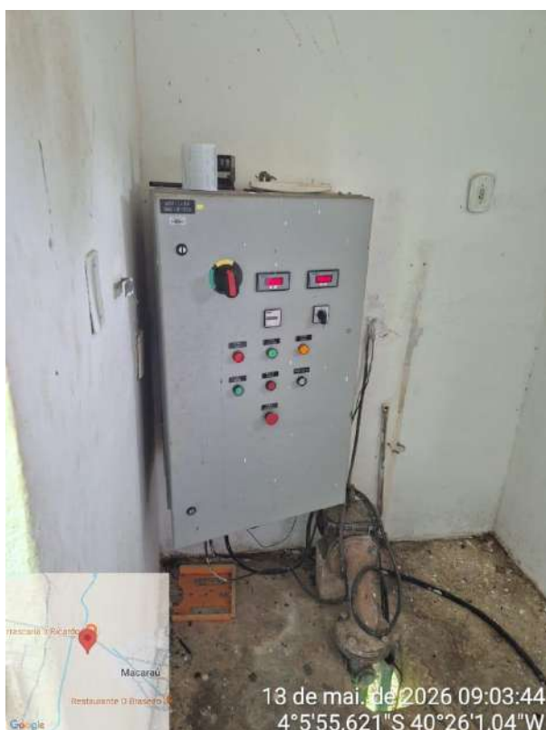
Foto 136 - PT-03 (Macaraú): casa do quadro de comando com sujeiras.
