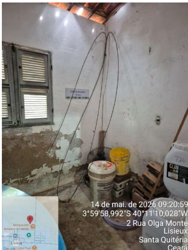
Foto 126 - ETA / Casa de química (Lisieux): piso e paredes desgastadas e com sujidades.
