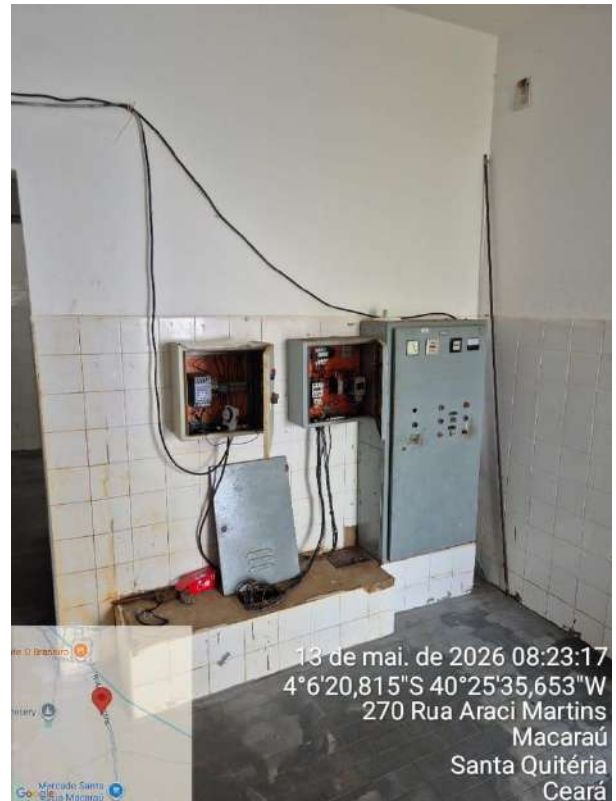
Foto 36 - ETA Macaraú: painéis sem tampa, fiação sem eletrodutos.
