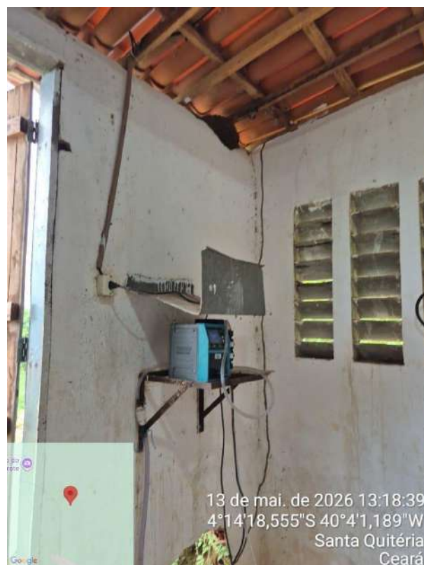
Foto 46 - Captação (sede): presença de cupim no telhado.
