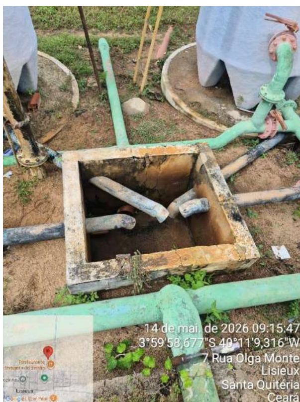
Foto 25 - ETA Lisieux: caixas sem grade de proteção.
