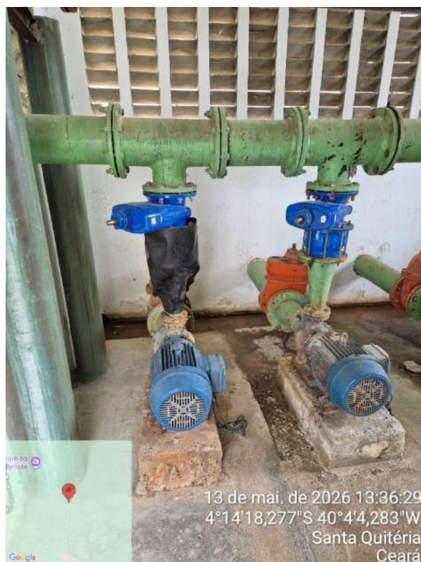
Foto 66 - ETA / Casa de bombas (sede): equipamentos com sujeira.
