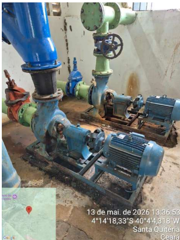
Foto 63 - ETA / Casa de bombas (sede): bombas sem proteção, bases oxidadas, piso com sujeira.
