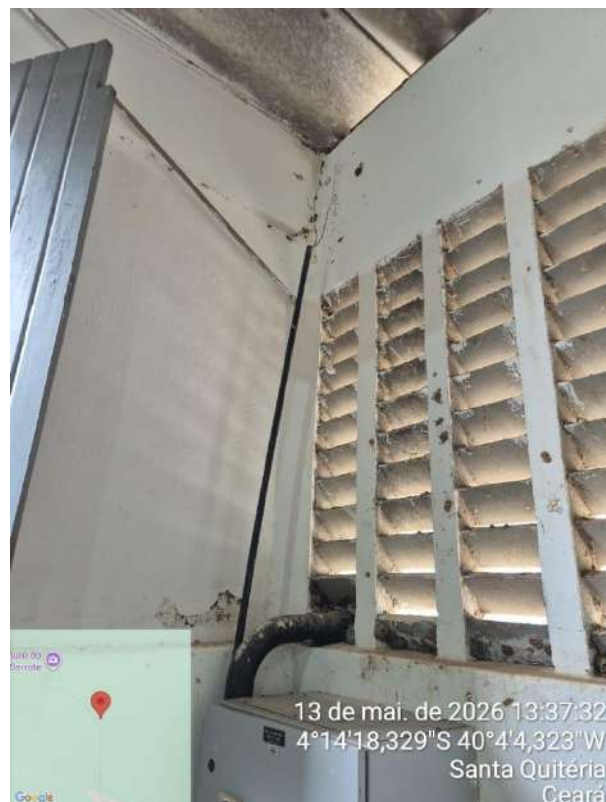
Foto 68 - ETA / Casa de bombas ( sede ): paredes com sujeira.
