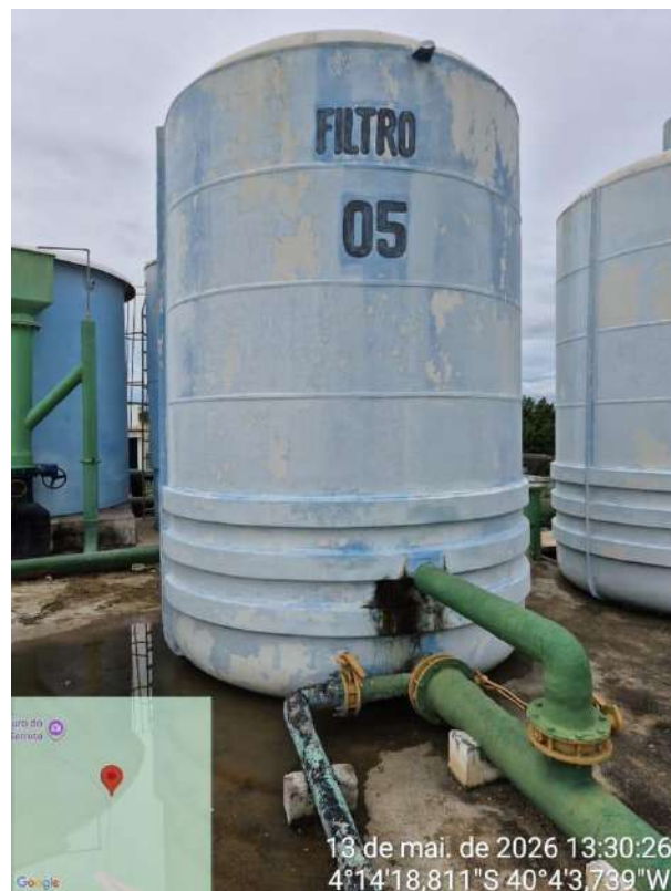
Foto 52 - ETA Santa Quitéria: F-05 com pintura e tubulação desgastada e vazamento.
