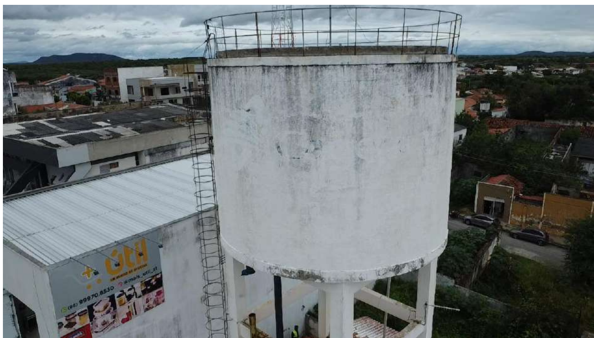
Foto 94 - REL-02 (sede): escada e guarda-corpo oxidados.
