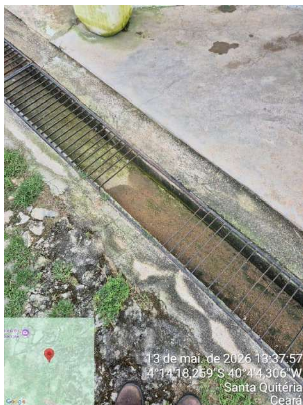
Foto 49 - ETA Santa Quitéria: grade das calhas incompleta.
