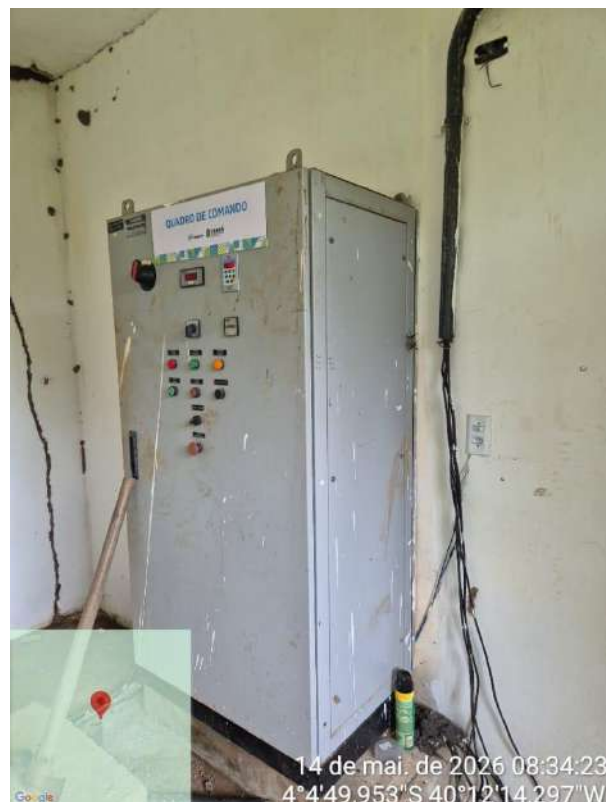
Foto 24 - EEAB-01 (Lisieux): parte da fiação sem eletrodutos.
