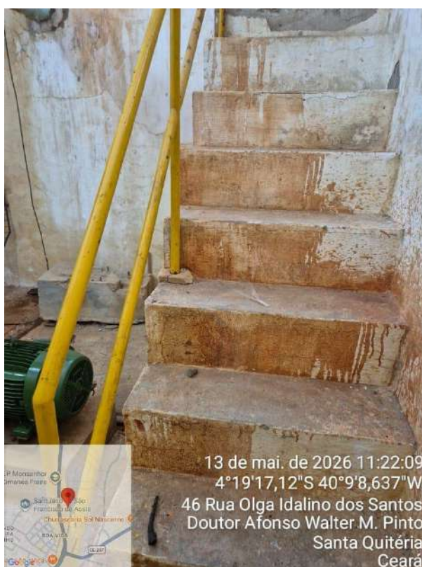
Foto 77 - EEAT-02 (sede): manchas de produto nas paredes e escada.
