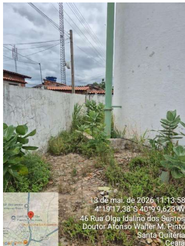
Foto 80 - REL-01 (sede): presença de vegetação no entorno e na tubulação.
