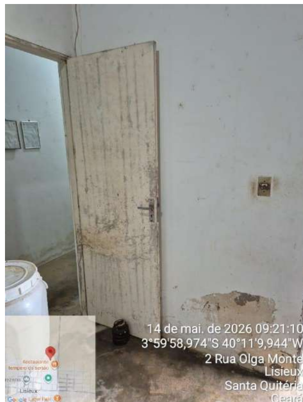
Foto 127 - ETA / Casa de química (Lisieux): piso e paredes desgastadas e com sujidades.
