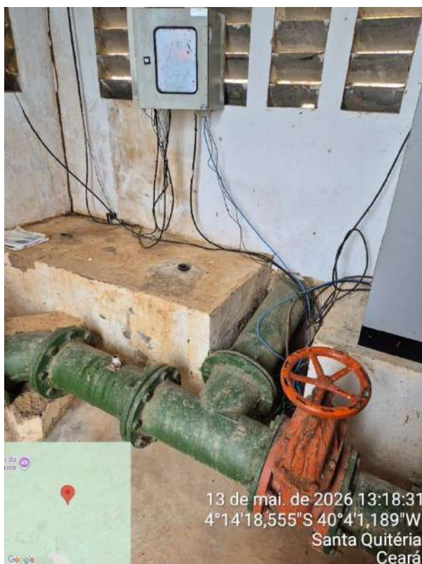
Foto 45 - Captação (sede): tubulação oxidada e com sujeira.
