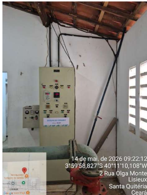
Foto 28 - ETA Lisieux: painéis com fiação sem eletrodutos.
