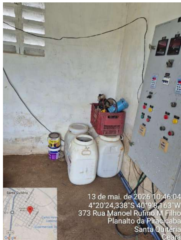
Foto 20 - EERD-02 (sede): fiação sem eletrodutos.
