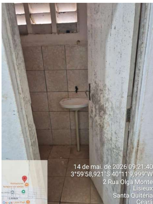
Foto 128 - ETA / Casa de química (Lisieux): banheiro com sujidades, desgastado.
