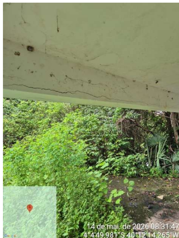
Foto 106 - EEAB-01 (Lisieux): estrutura comprometida, com rachaduras nos pilares e paredes.
