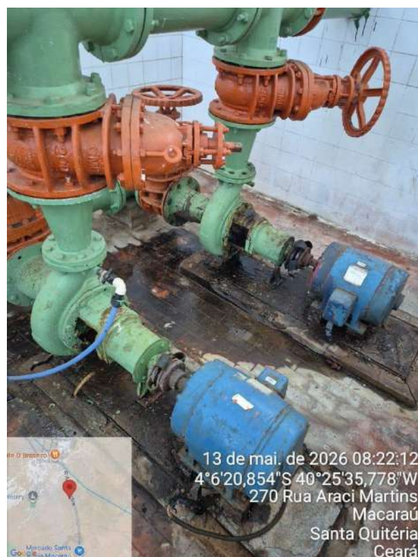
Foto 147 - ETA / Casa de bombas (Macaraú): bombas sem proteção e com vazamento.
