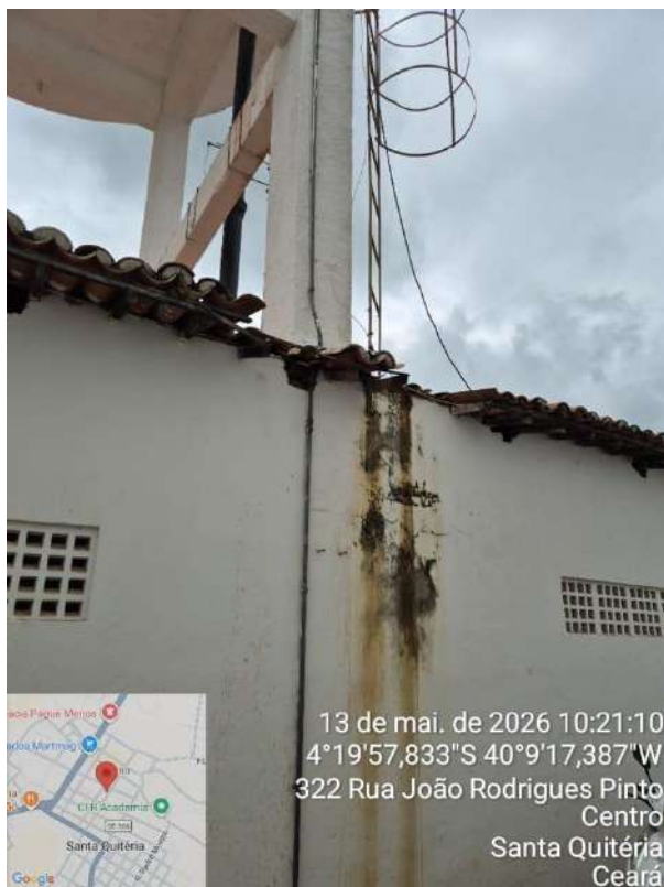
Foto 16 - REL-02 (sede): fiação exposta na escada.
