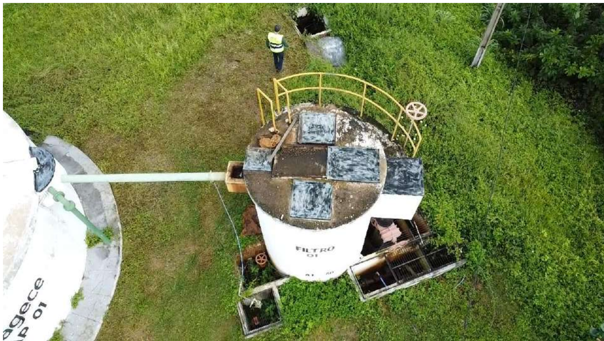
Foto 142 - ETA Macaraú: F-01 com grade das caixas de registro danificadas e tampas desgastadas.
