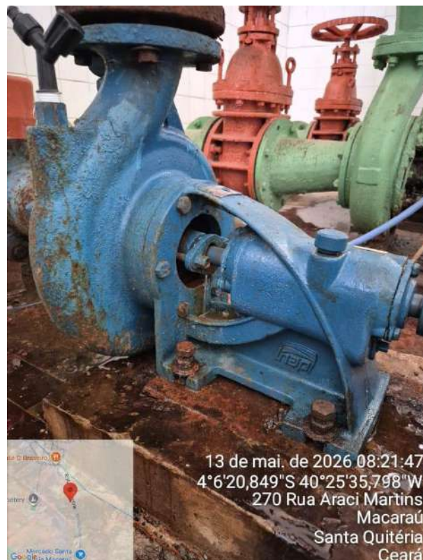
Foto 145 - ETA / Casa de bombas (Macaraú): bombas oxidadas e com vazamento.
