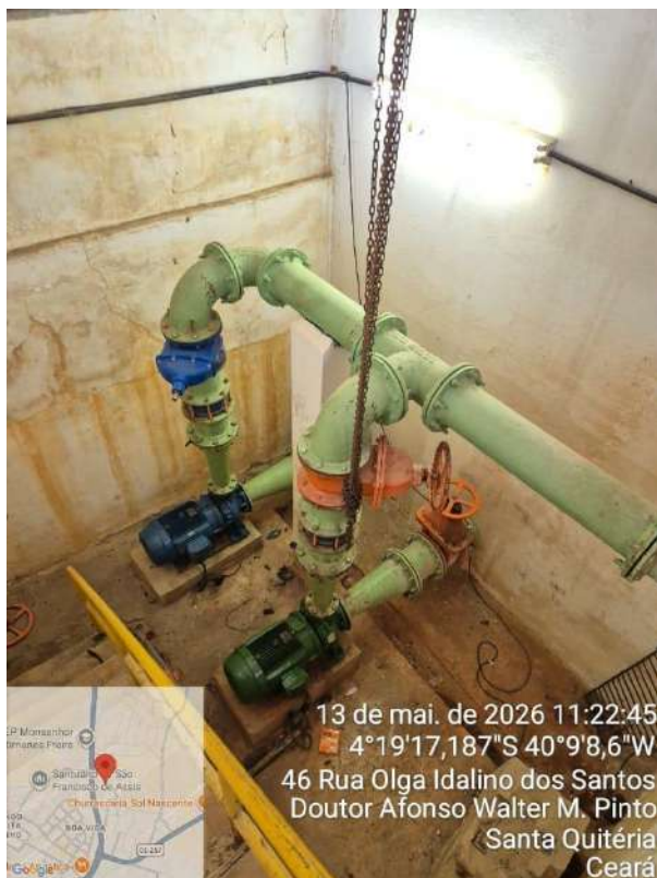
Foto 9 - EEAT-02 (sede): fiação inadequada e sem eletrodutos.
