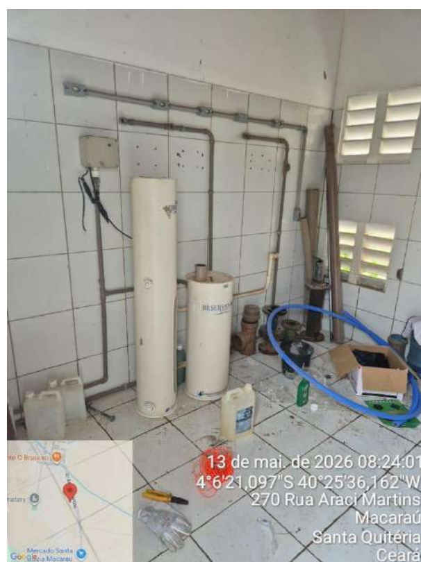
Foto 151 - ETA / Casa de química (Macaraú): acúmulo de material e sujeidades.
