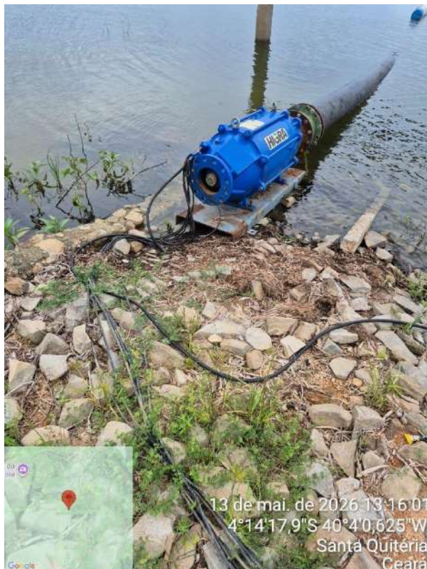
Foto 1 - Captação (sede): bombas e painéis com fiação sem eletrodutos.
