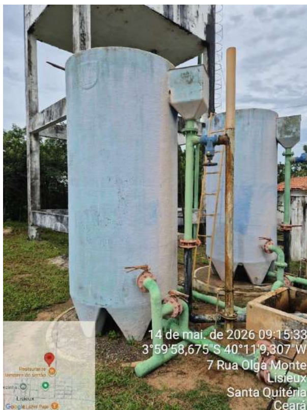
Foto 120 - ETA / Filtros (Lisieux): pintura desgastada, tubulações oxidadas.
