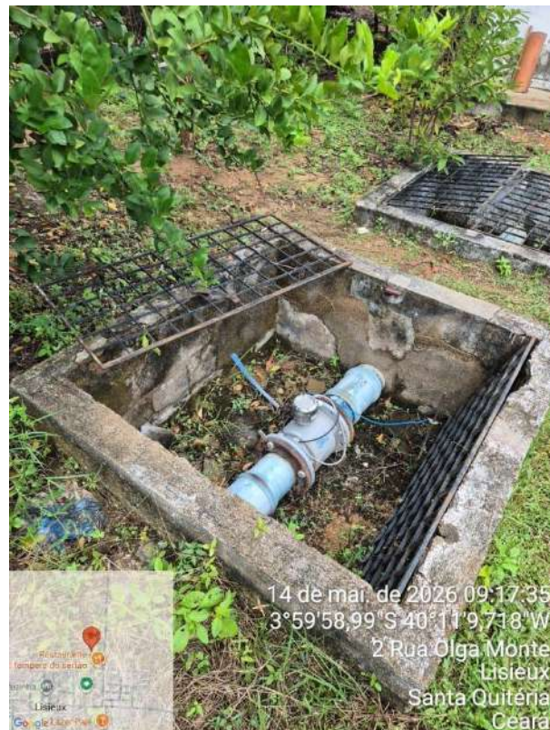
Foto 112 - ETA Lisieux: caixa de registro com grade deslocada.
