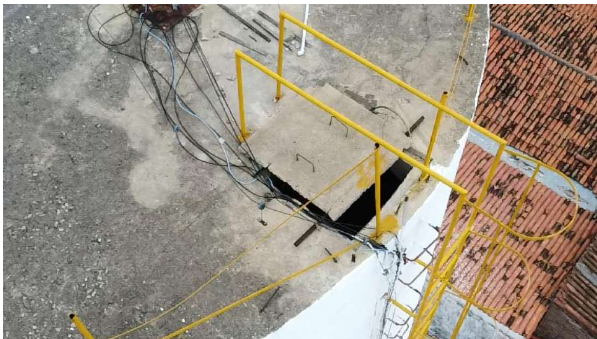
Foto 1 - REL-01 (Sede): Tapa semiaberta e fiação elétrica inadequada.
