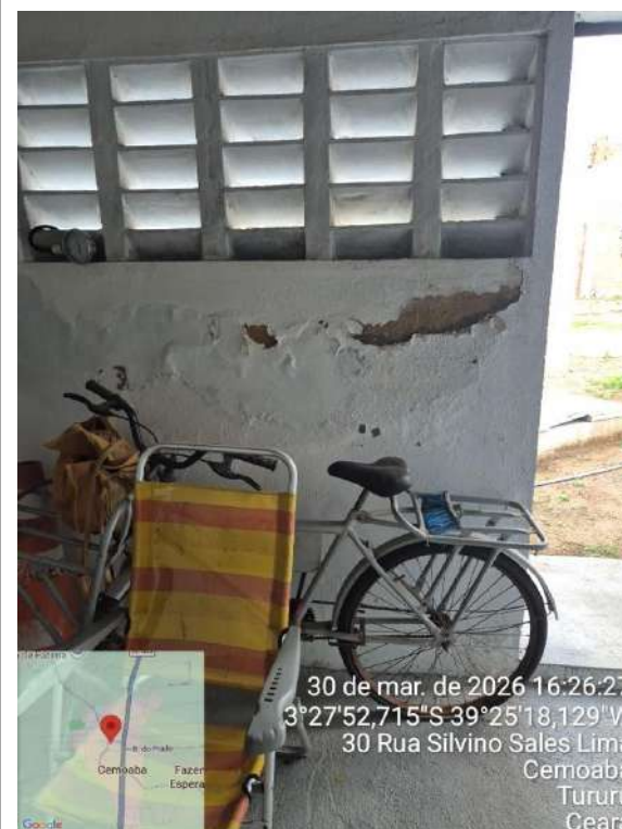
Foto 8 - Casa de Química e Laboratório (Cemoaba): reboco das paredes deteriorado.
