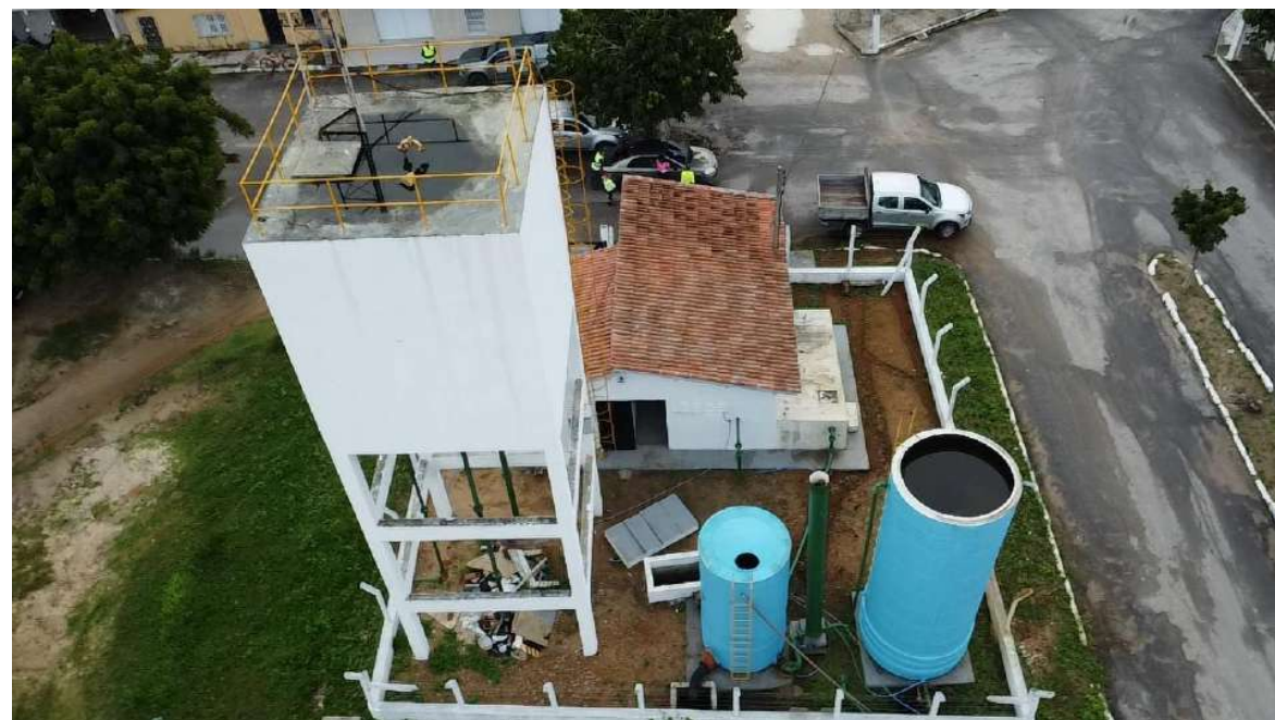
Foto 4 - REL-01 / F-01 ( Cemoaba ): presença de entulho na base da estrutura e escada do filtro sem guarda-corpo.
