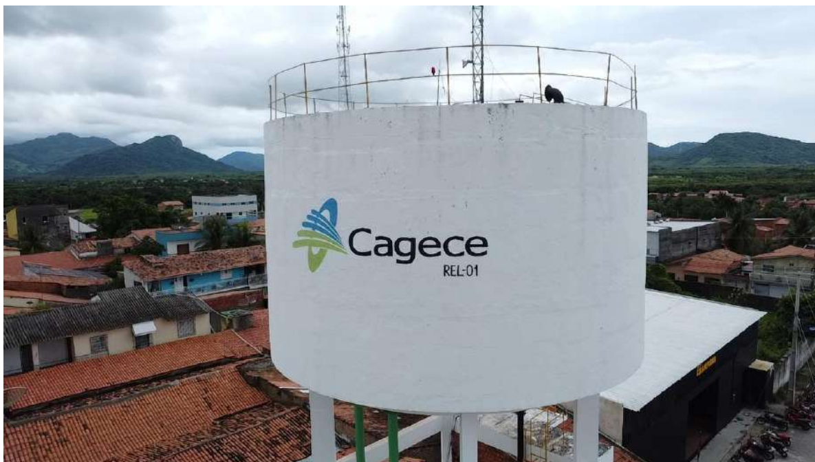
Foto 9 - REL-02 (Sede): divergência na identificação do reservatório.
