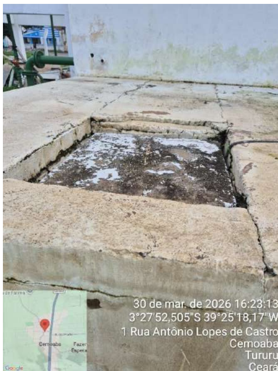
Foto 5 - RSE-01 (Cemoaba): tampa mal posicionada (abaixo do nível de vedação).
