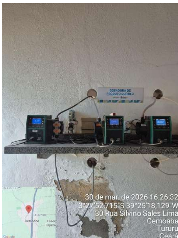
Foto 7 - Casa de Química e Laboratório (Cemoaba): reboco das paredes deteriorado.
