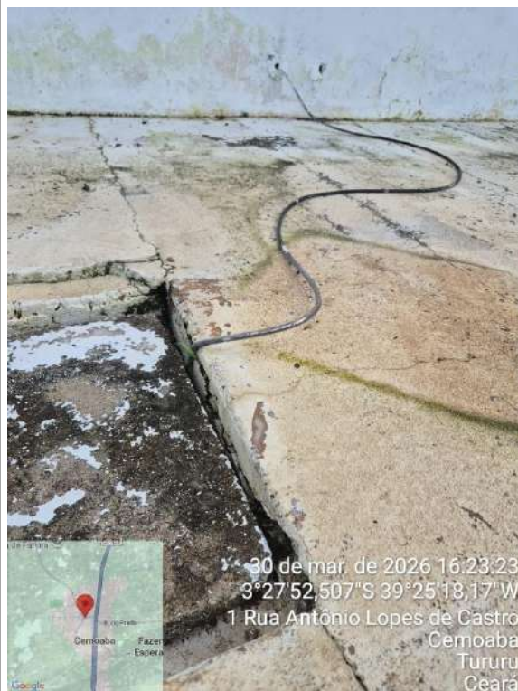
Foto 6 - RSE-01 (Cemoaba): cabeamento elétrico exposto.
