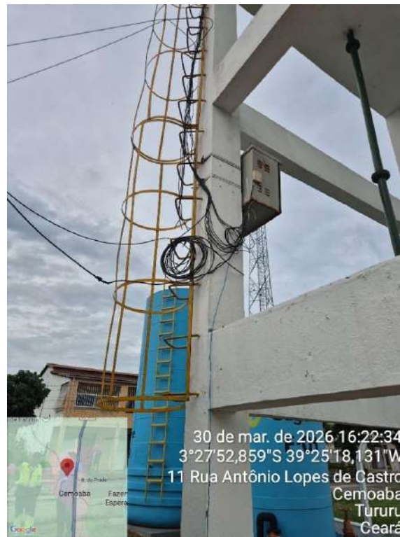
Foto 3 - REL-01 ( Cemoaba ): fios e cabos elétricos dispostos junto à escada de acesso.
