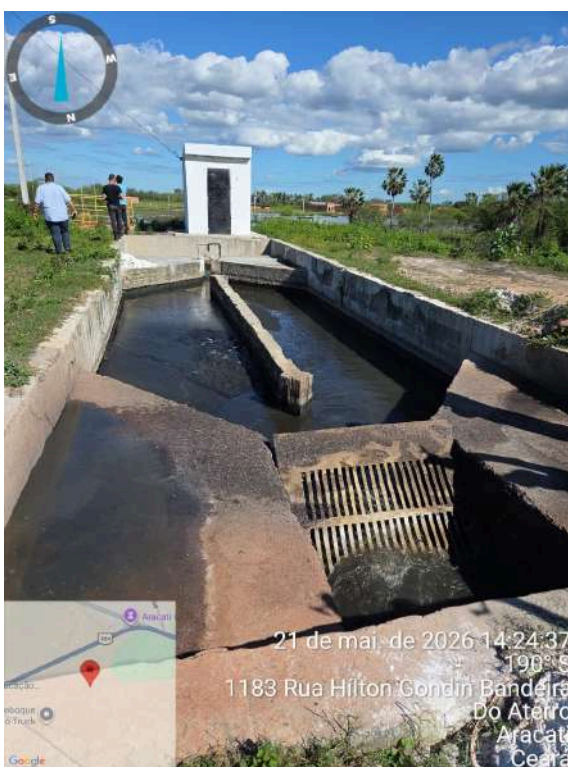
Foto 257 - ETE Aracati: caixa de areia com sujidade.
