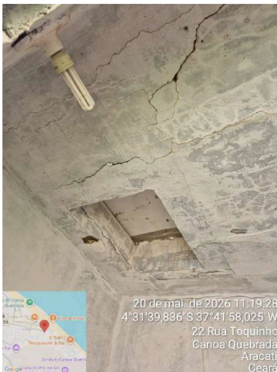
Foto 198 - PT-04 (Canoa): teto com rachaduras.
