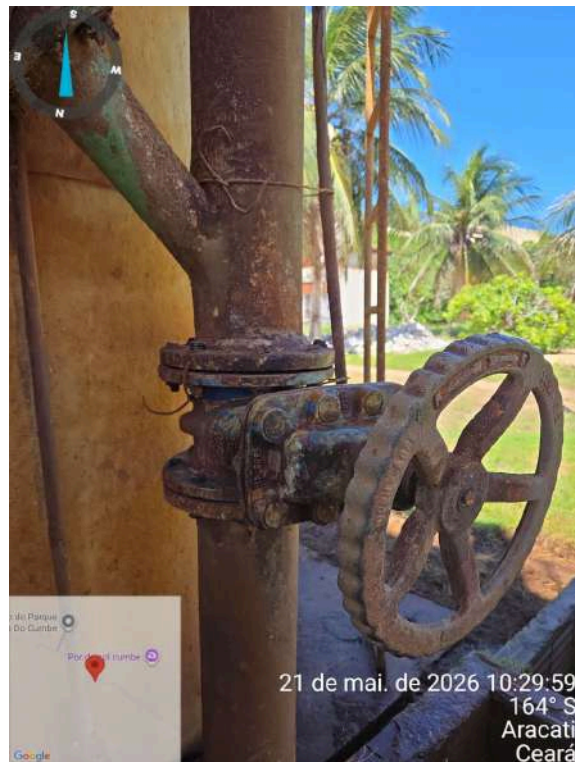
Foto 106 - ETA Cumbe (sede): F-04 com válvula e tubulação oxidada.
