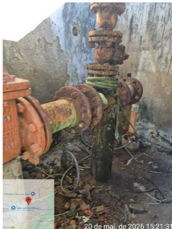
Foto 241 - PT-02 (Majorlândia): bomba com vazamento, tubulação oxidada.
