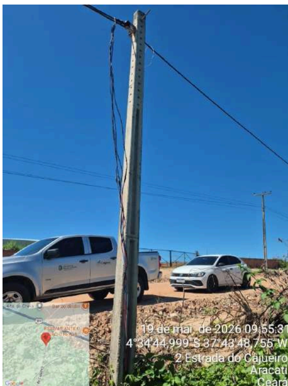
Foto 28 - PT-34 (sede): fiação solta sem proteção.
