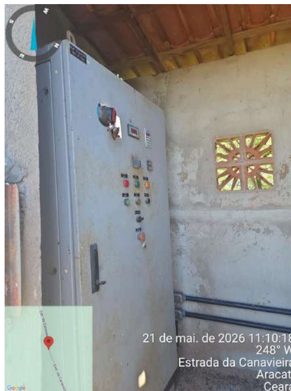
Foto 141 - Booster Canaveira (sede): casa de marimbondo nos painéis, caixa de energia e janela.
