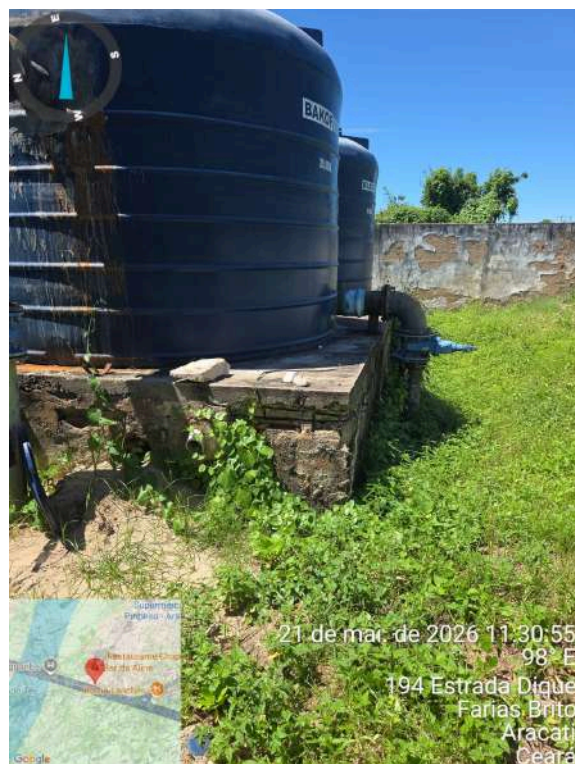
Foto 147 - Booster BR (sede): RSE desativado com estrutura desgastada de apoio dos RAPs, armadura exposta.
