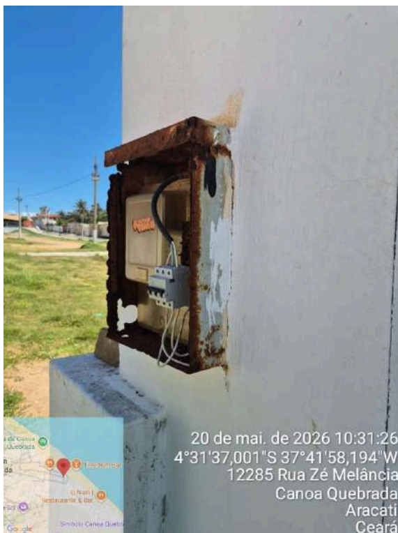
Foto 166 - PT-05 (Canoa): caixa de energia sem tampa e oxidação avançada.
