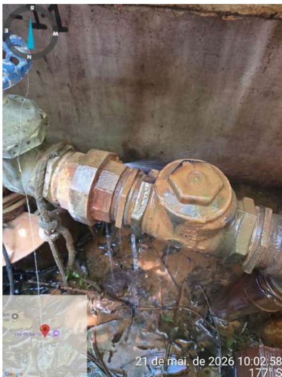
Foto 85 - PT-11 (sede): poço com vazamento intenso.
