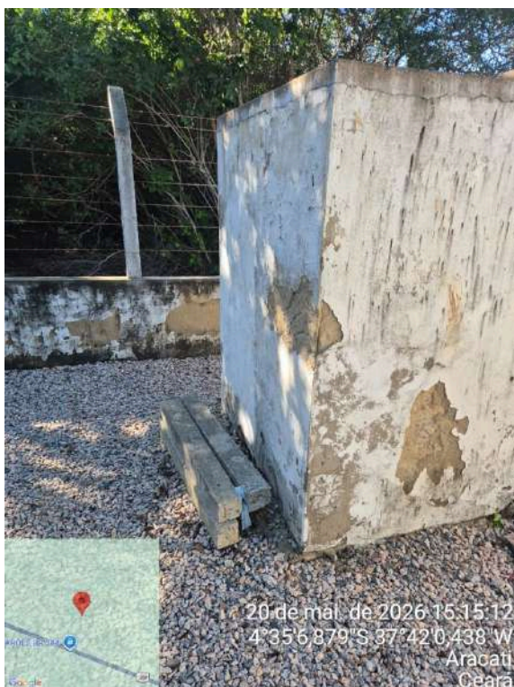
Foto 234 - PT-03 (Majorlândia): sem escada de acesso, parede desgastada.
