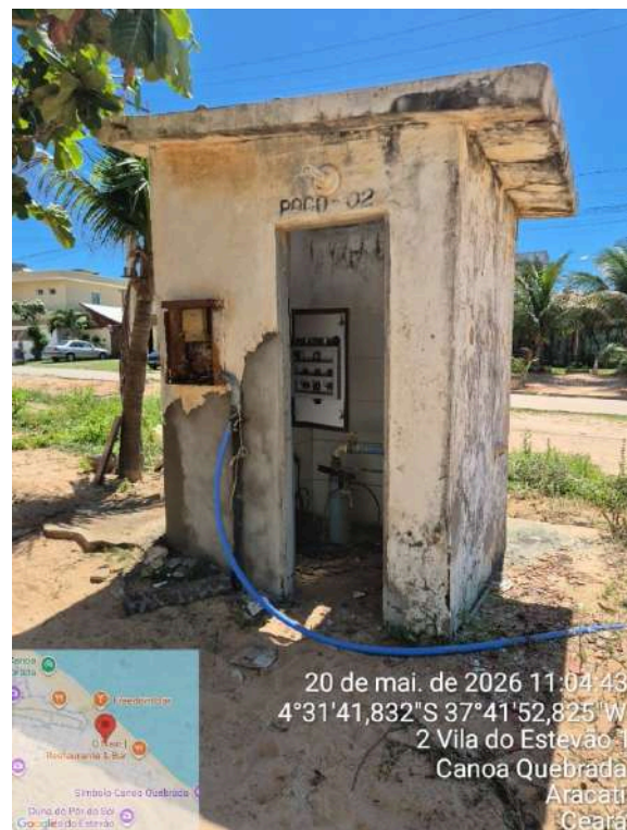
Foto 183 - PT-02 ( Canoa ): paredes e teto desgastados, com mangueira solta na passagem, porta quebrada.
