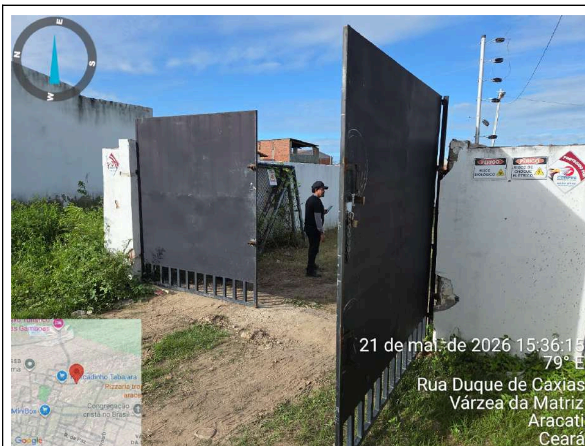
Foto 285 - EEE Tabajaras ( sede ): sem identificação, muro parcialmente quebrado.
