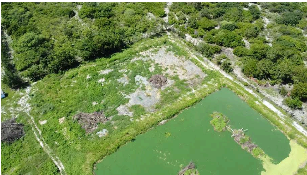
Foto 295 - ETE Canoa Quebrada: leito de secagem com vegetação acumulada.
