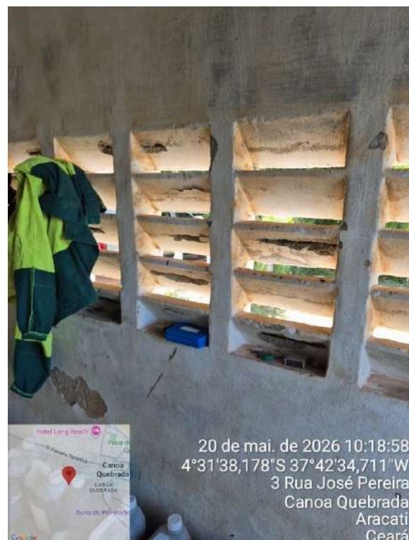
Foto 291 - ETE Canoa Quebrada: casa de apoio com armadura exposta.
