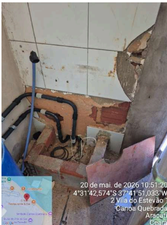
Foto 174 - EEAT-01 (Canoa): paredes desgastadas.
