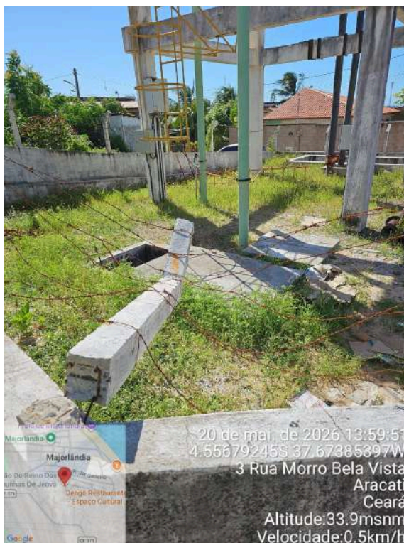
Foto 206 - REL-01 (Majorlândia): cerca danificada.
