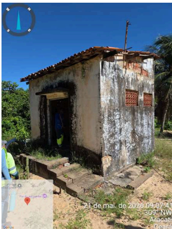
Foto 51 - Casa de comando PT-03 e PT-28 (sede): paredes e escada sujas e deterioradas.
