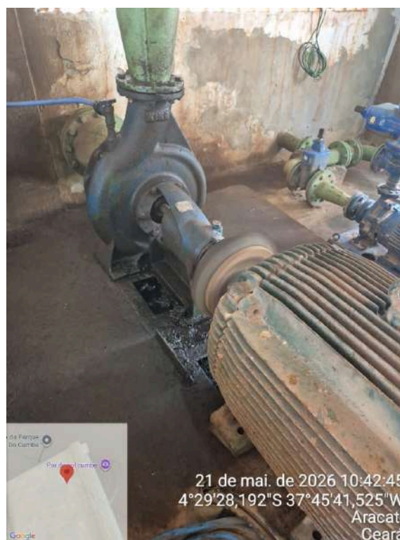
Foto 129 - ETA Cumbe / Casa de bombas ( sede ): bomba sem caixa de proteção.
