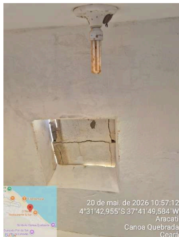
Foto 181 - PT-01 (Canoa): teto com peça de concreto com fissuras.
