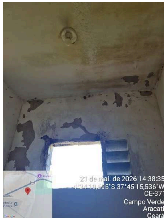
Foto 260 - ETE Aracati: casa de apoio com parede desgastada.
