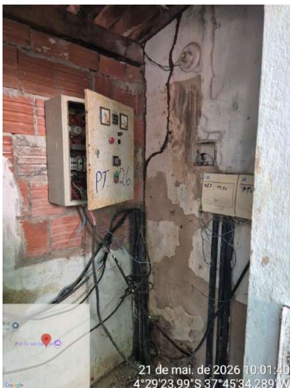
Foto 87 - PT-11 (sede): casa de comando dos PT-10, 11 e 26 com parede desgastada, fiação solta sem proteção.
