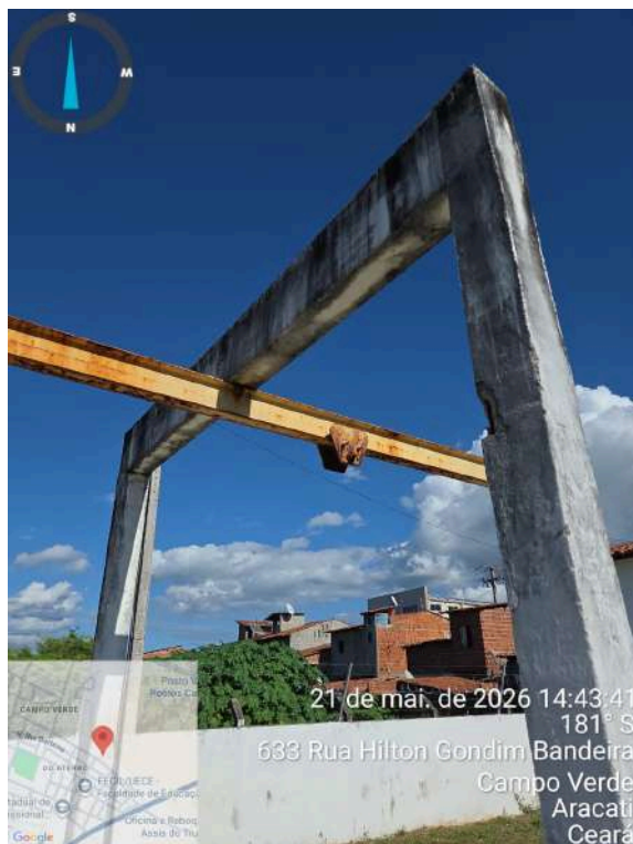
Foto 267 - EEE-A (sede): monovia oxidada.
