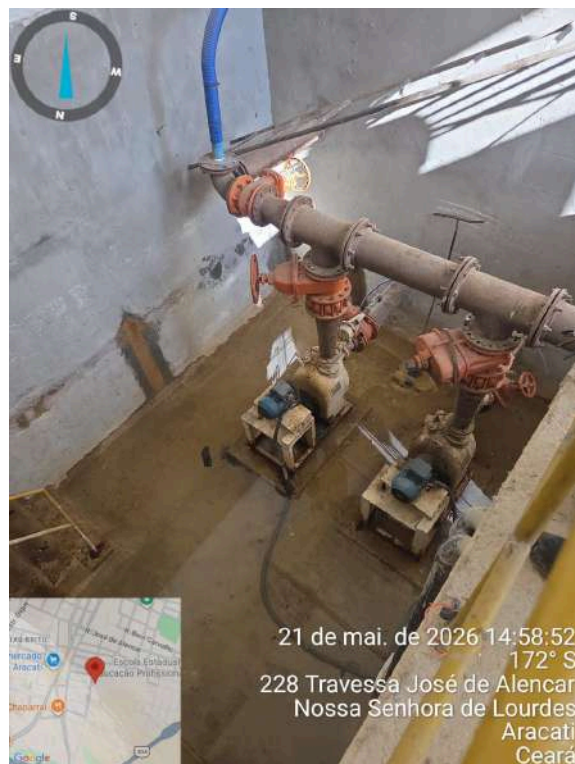
Foto 268 - EEE-B (sede): infiltração na região das bombas, bombas sem proteção.
