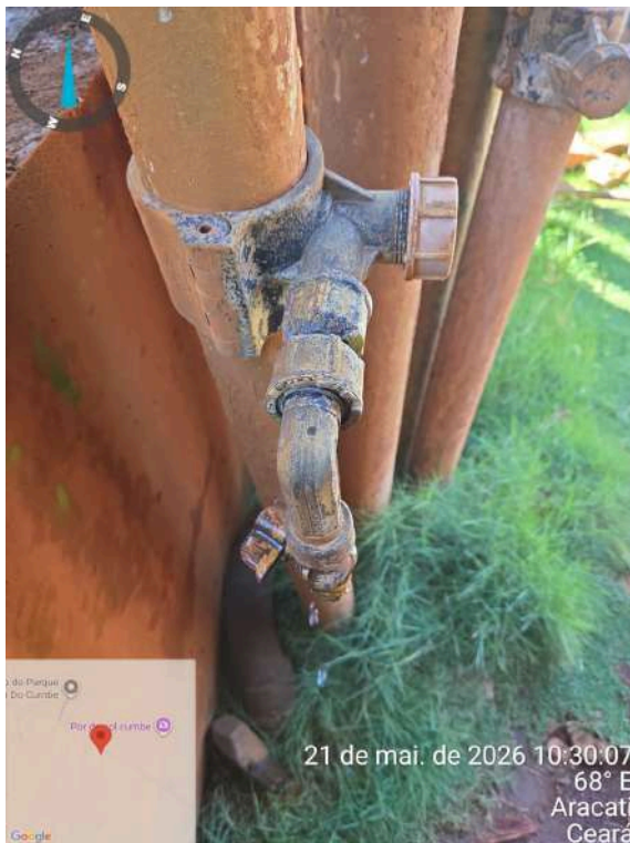
Foto 105 - ETA Cumbe (sede): vazamento no aerador na entrada do PT-30.
