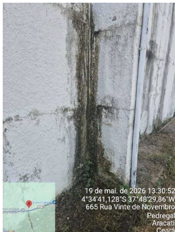
Foto 37 - RAP-04 (sede): muitos pontos de vazamento e infiltração nas paredes do reservatório.
