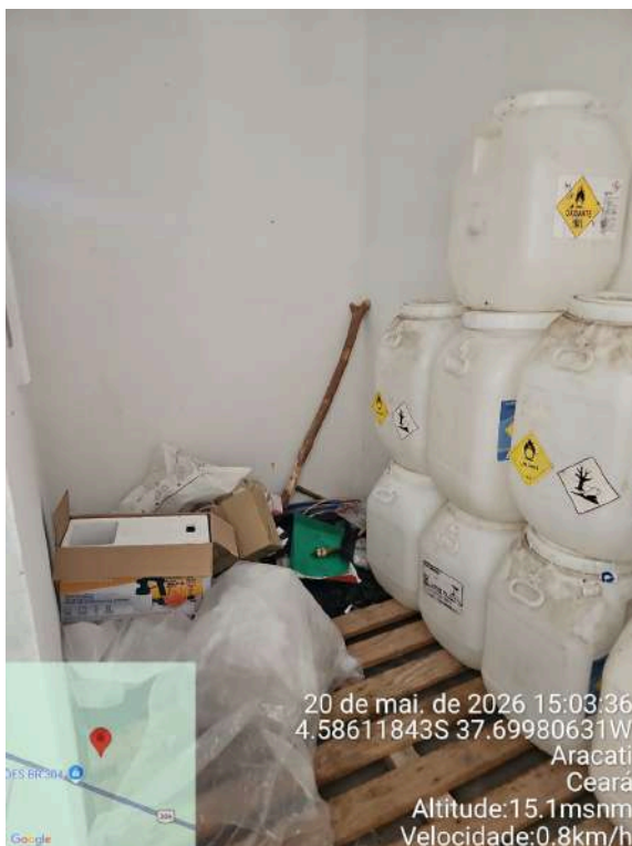
Foto 224 - EEAT-01 (Majorlândia): Casa de Química com acúmulo de material descartado na contenção.
