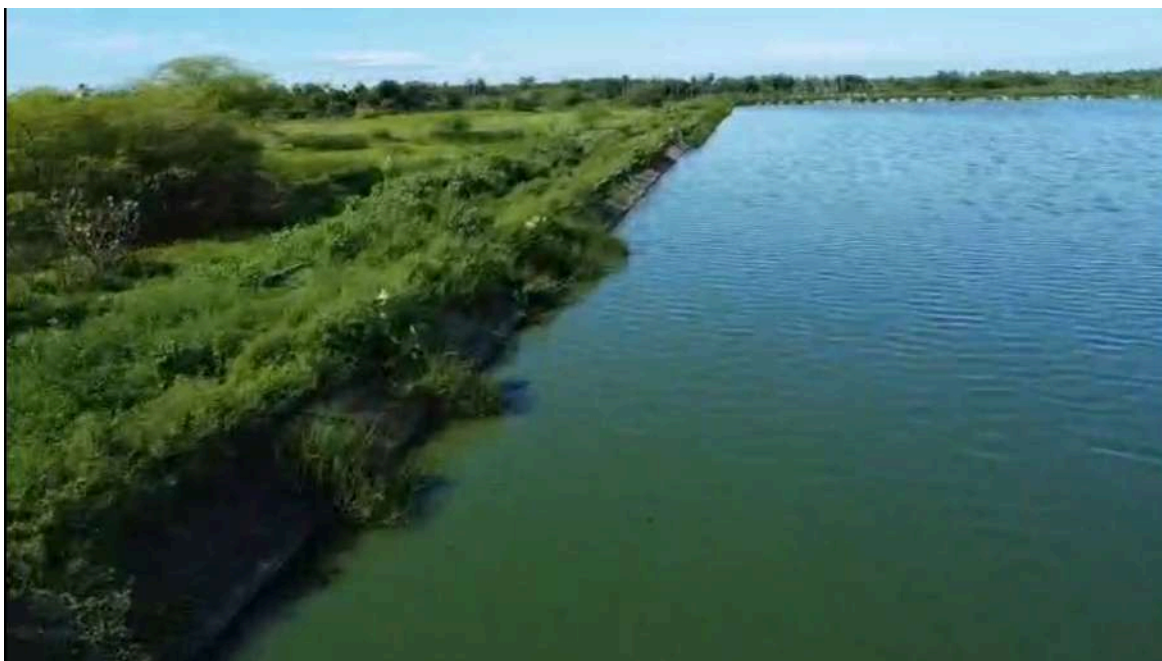
Foto 255 - ETE Aracati : talude com vegetação alta, dificultando acesso.
