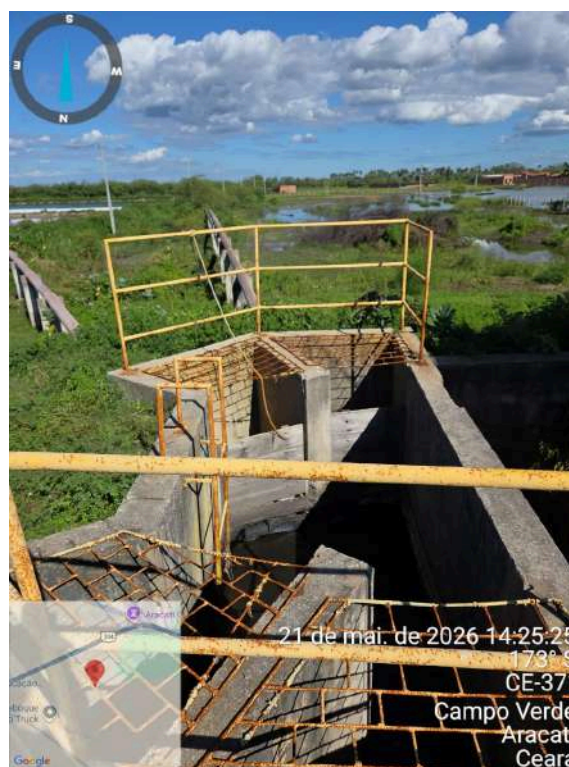
Foto 258 - ETE Aracati: grade com oxidação.
