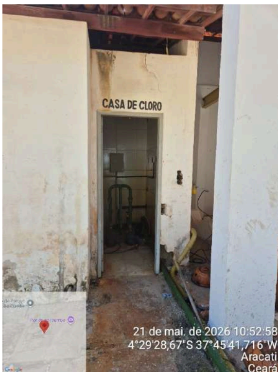
Foto 136 - ETA Cumbe / Casa de cloro (sede): viga e parede com danos estruturais.
