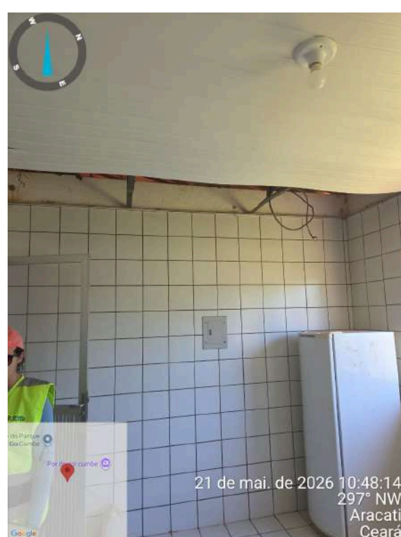
Foto 133 - ETA Cumbe / Casa de apoio (sede): copa sem forro do teto completo.
