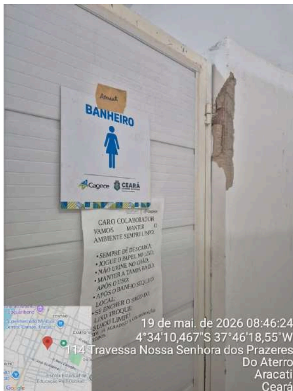
Foto 10 - Núcleo Aracati (sede): banheiro com porta com dobradiça quebrada.
