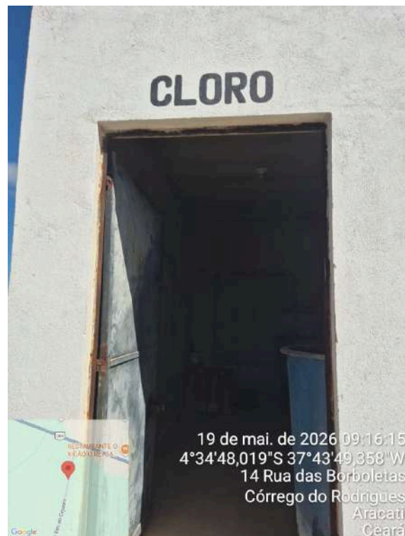
Foto 15 - EEAT-06 (sede): casa de cloração sem ventilação.
