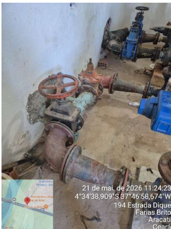
Foto 146 - Booster BR (sede): bombas com tubulação oxidada e aberturas na parede.
