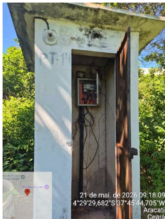
Foto 64 - PT-14: casa de comando sem lâmpada e com fiação sem proteção.
