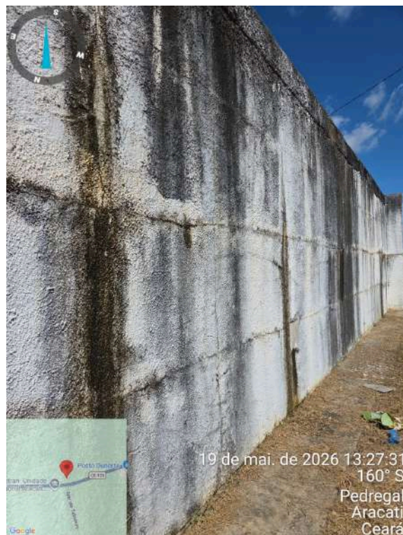
Foto 35 - RAP-04 (sede): muitos pontos de vazamento e infiltração nas paredes do reservatório.
