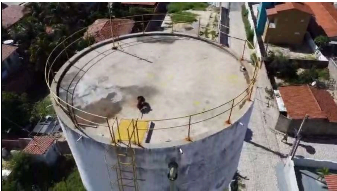
Foto 210 - REL-01 (Majorlândia): suspiro e guarda-corpo oxidados.
