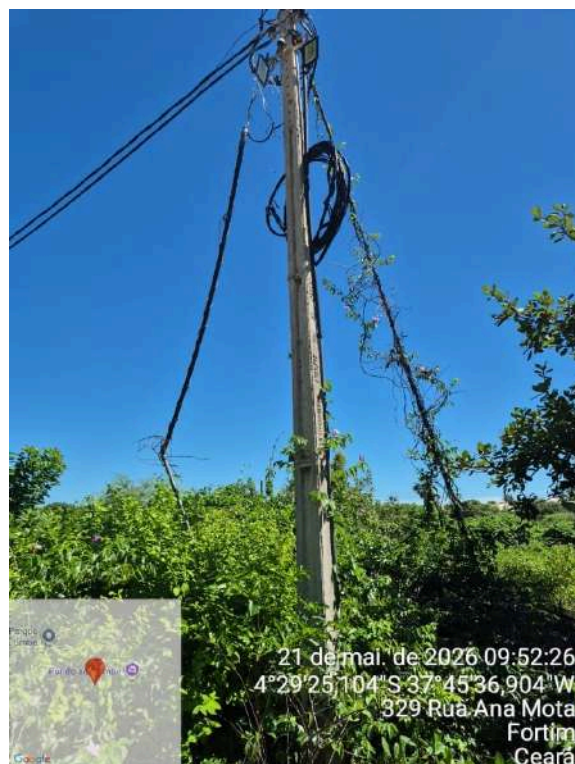
Foto 76 - PT-19 (sede): fiação próxima ao poço caída, apresentando risco de acidentes.
