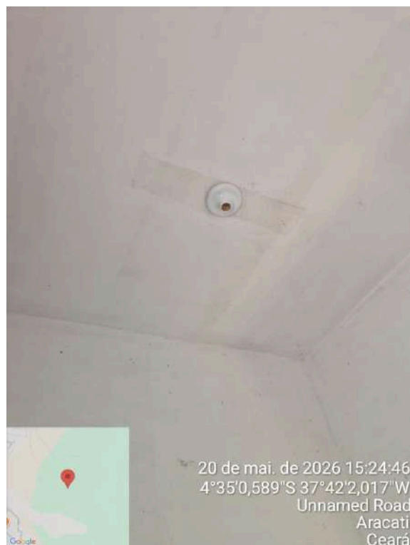
Foto 243 - PT-01 (Majorlândia): casa de comando sem lâmpada.
