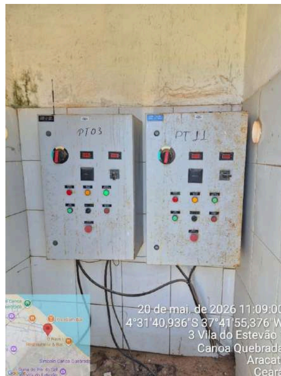
Foto 191 - PT-03 (Canoa): fiação sem proteção.
