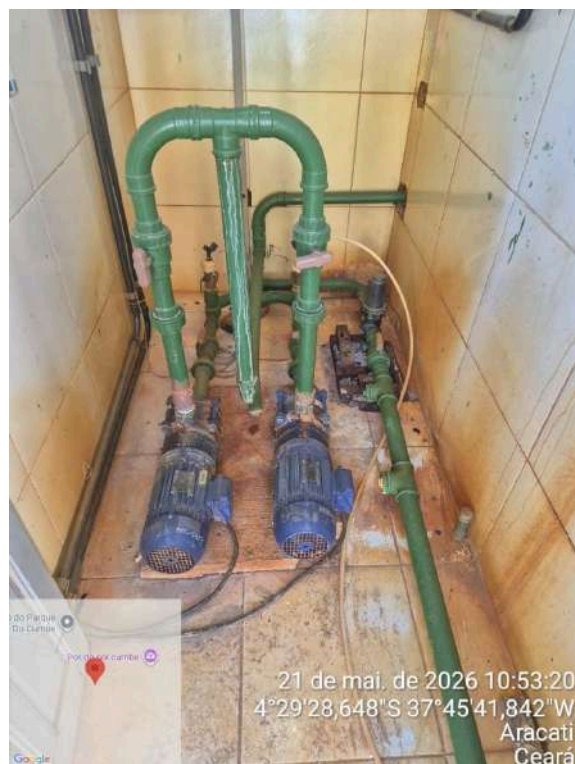
Foto 137 - ETA Cumbe / Casa de cloro (sede): fiação das bombas sem eletrodutos, piso com ferrugem, peças oxidadas.
