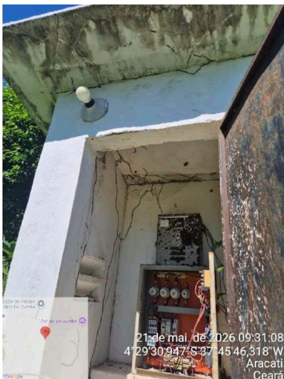
Foto 67 - PT-23 (sede): casa de comando com lâmpada queimada; abrigo dos fusíveis e porta oxidados.
