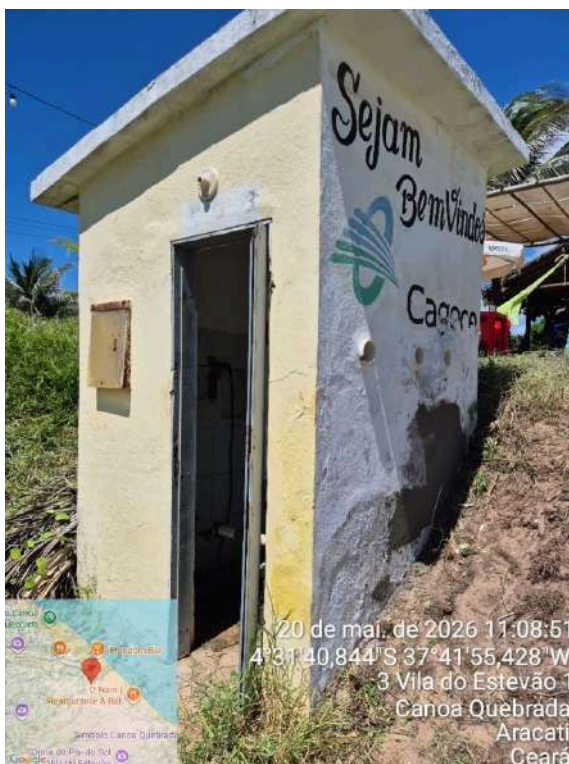
Foto 188 - PT-03 (Canoa): casa de comando sem porta e iluminação.
