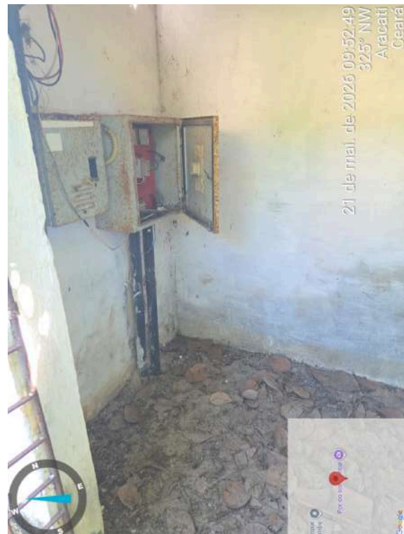
Foto 78 - PT-29 (sede): casa de comando com painel oxidado e piso com sujeira.
