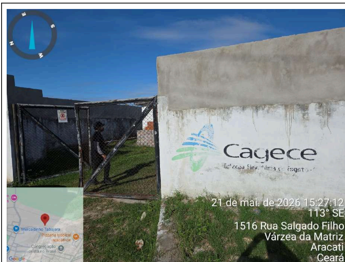
Foto 275 - EEE-G (sede): identificação desgastada, portão oxidado.
