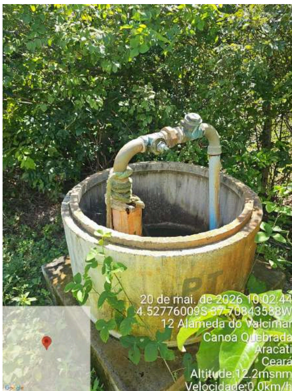
Foto 162 - PT-12 (Canoa): poço com vazamento e sem proteção.
