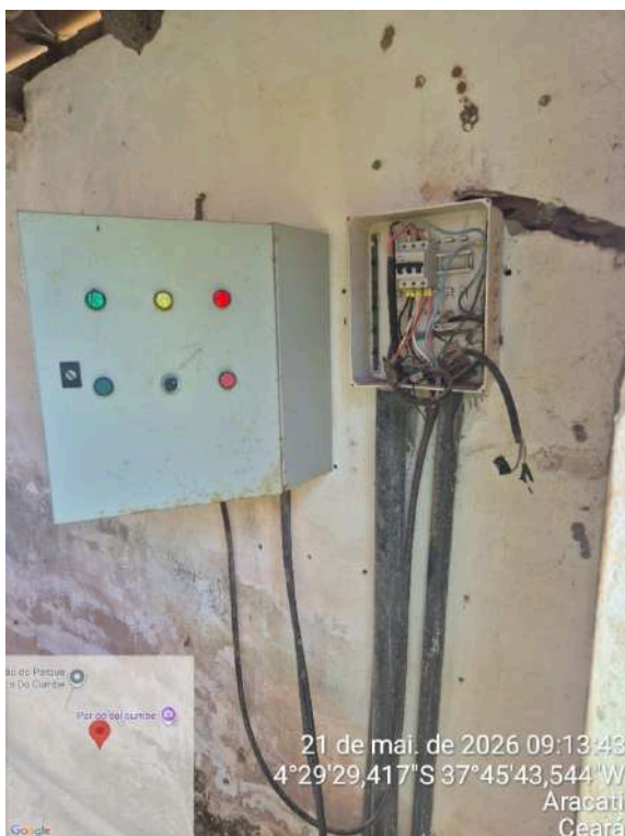
Foto 59 - PT-42 (sede): painel de energia sem tampa e com fiação solta sem proteção.
