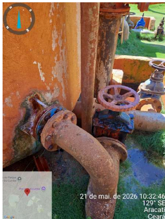
Foto 110 - ETA Cumbe (sede): F-02 com vazamento na válvula e na parede próxima a entrada, com presença de lodo.
