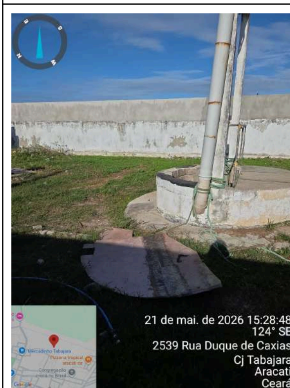
Foto 276 - EEE-G (sede): tampa quebrada disposta ao lado.
