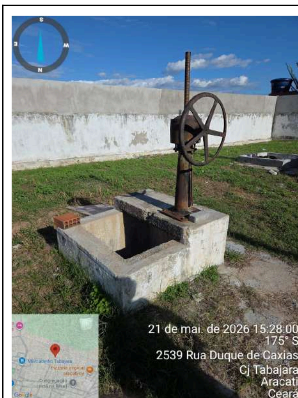
Foto 278 - EEE-G (sede): fosso sem tampa, válvula oxidada.
