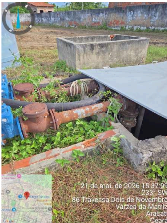
Foto 288 - EEE Tabajaras (sede): tubulações com vegetação alta e oxidadas.
