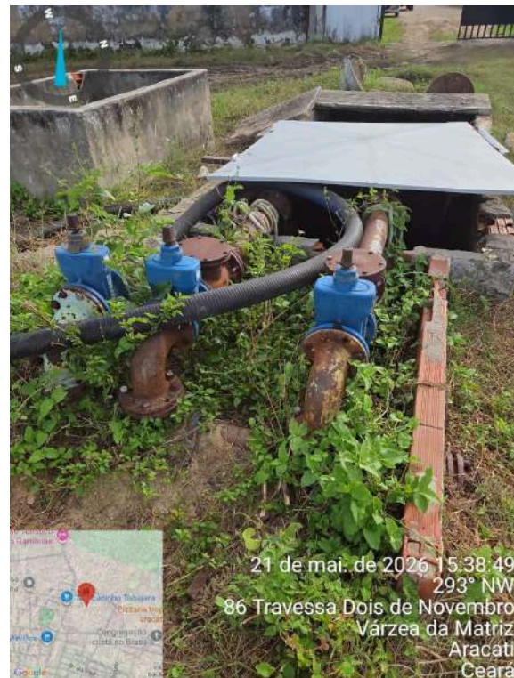
Foto 289 - EEE Tabajaras (sede): tubulações com vegetação alta e oxidadas.
