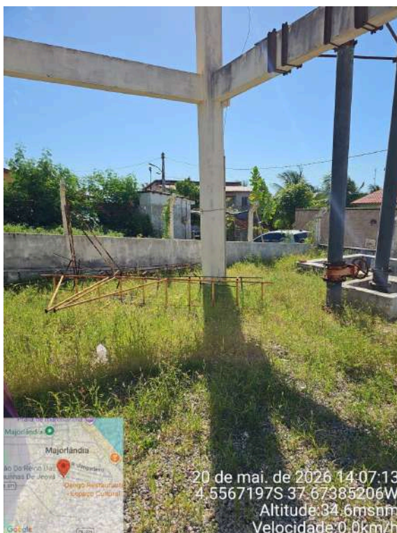
Foto 208 - REL-01 (Majorlândia): acúmulo de material inadequado.
