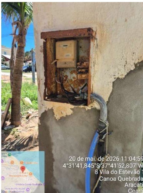
Foto 186 - PT-02 (Canoa): caixa de energia sem tampa e oxidada.
