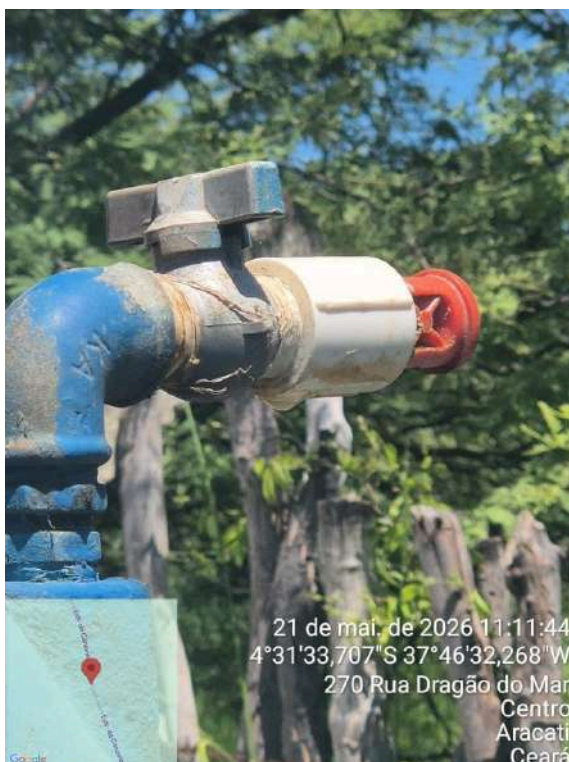
Foto 142 - Booster Canaveira (sede): registro com vazamento.
