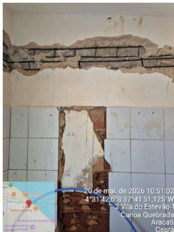
Foto 173 - EEAT-01 (Canoa): teto com armadura completamente exposta, paredes desgastadas.
