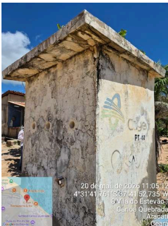
Foto 184 - PT-02 ( Canoa ): paredes e teto desgastados.
