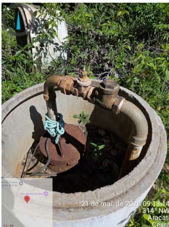
Foto 55 - PT-21 (sede): junção com vazamento e sem anel de proteção completo.
