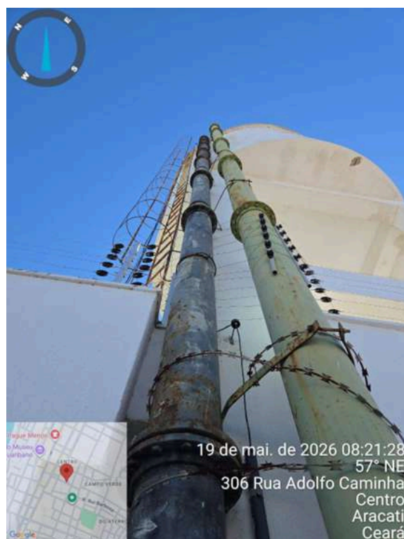
Foto 4 - REL-01 (sede): oxidação na tubulação.
