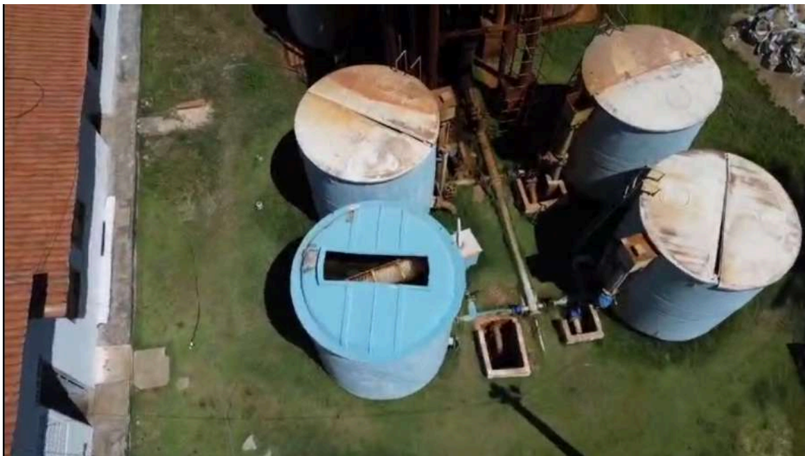
Foto 117 - ETA Cumbe (sede): F-06 sem tampa.
