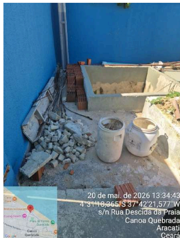
Foto 298 - EEE-01 (Canoa): acúmulo de material de descarte inadequado.
