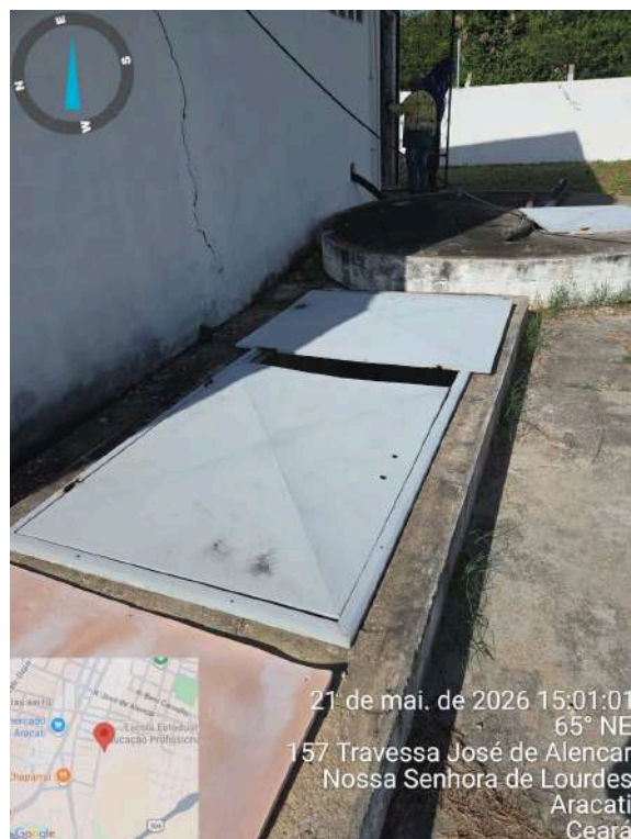
Foto 270 - EEE-B (sede): tampa sem vedação.
