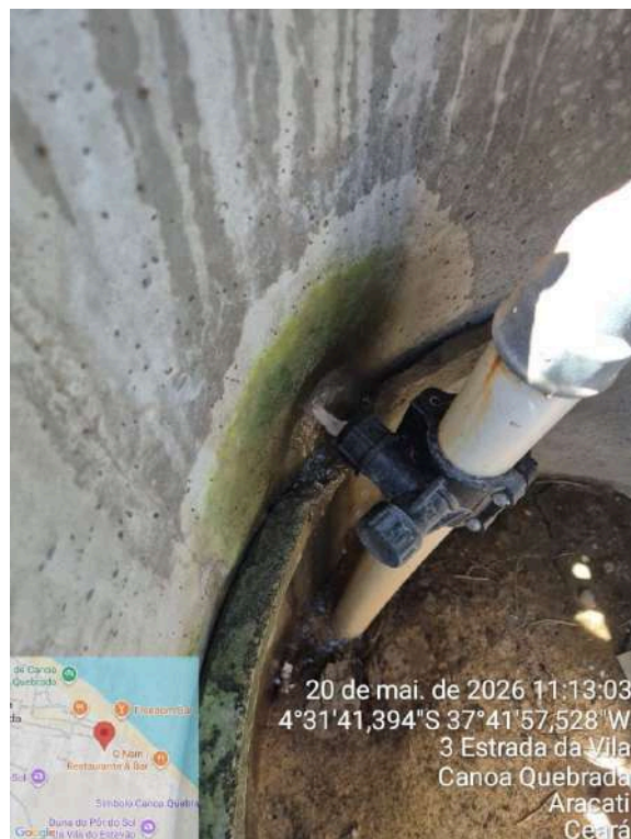
Foto 195 - PT-11 (Canoa): vazamento extremo no colar.
