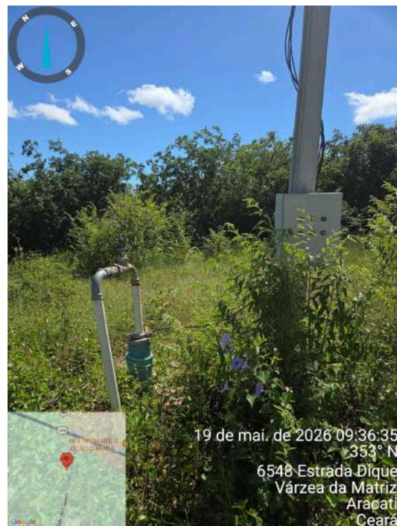
Foto 23 - PT-36 (sede): sem proteção, identificação e com fiação solta.
