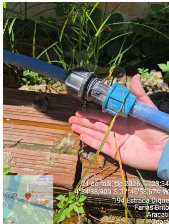
Foto 145 - Booster BR (sede): mangueira com vazamento na junção.
