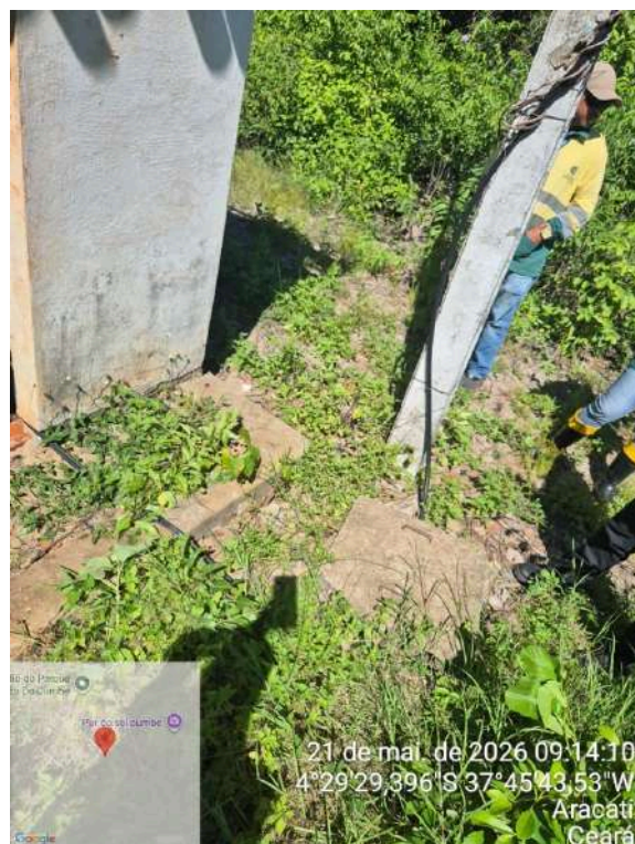
Foto 60 - PT-42 (sede): fiação sem proteção escondida pela vegetação.
