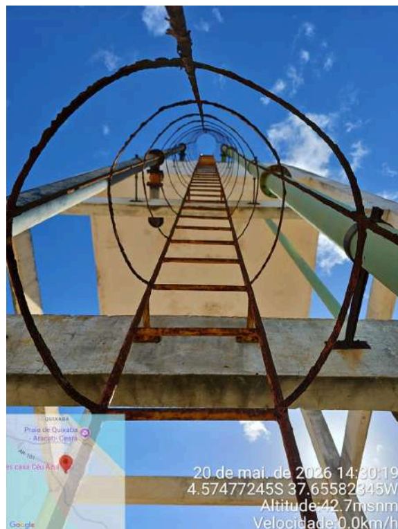
Foto 213 - REL-02 (Quixaba): escada com oxidação elevada.
