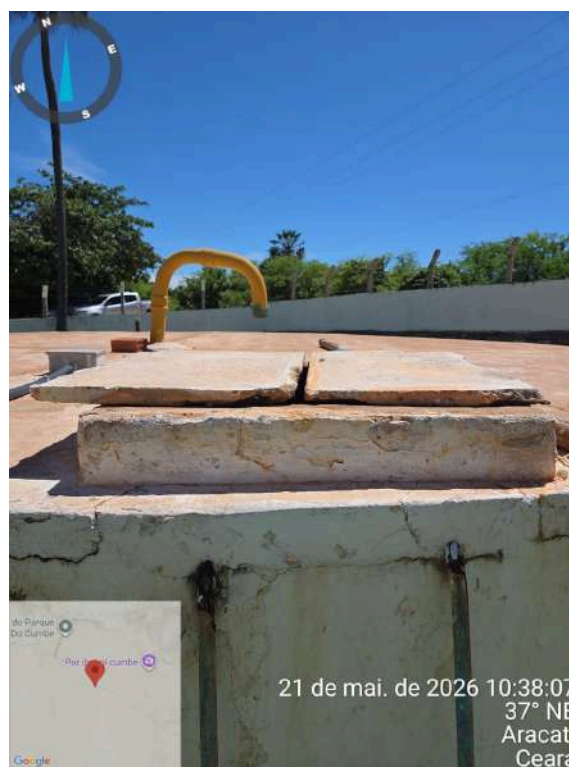
Foto 119 - ETA Cumbe / RAP-01 (sede): tampa quebrada, parcialmente aberta, escada oxidada.
