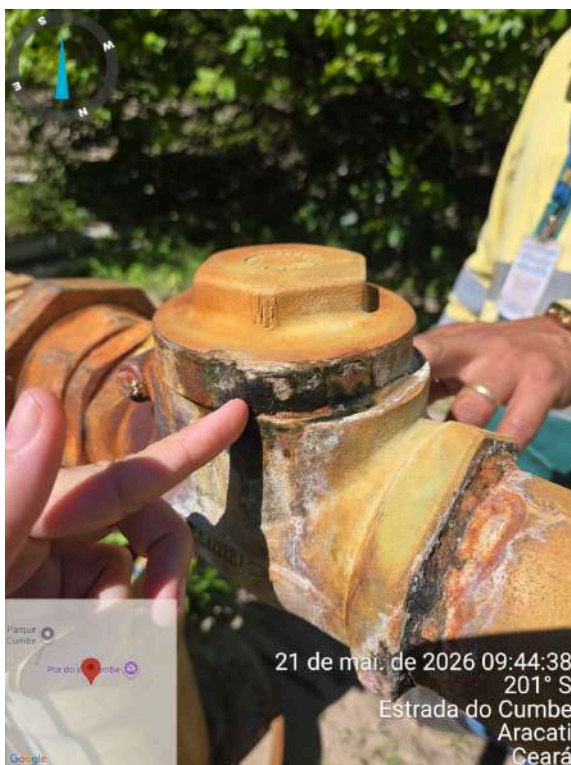
Foto 71 - PT-43 (sede): início de vazamento.
