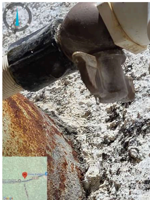
Foto 31 - RAP-04 (sede): vazamento no registro.
