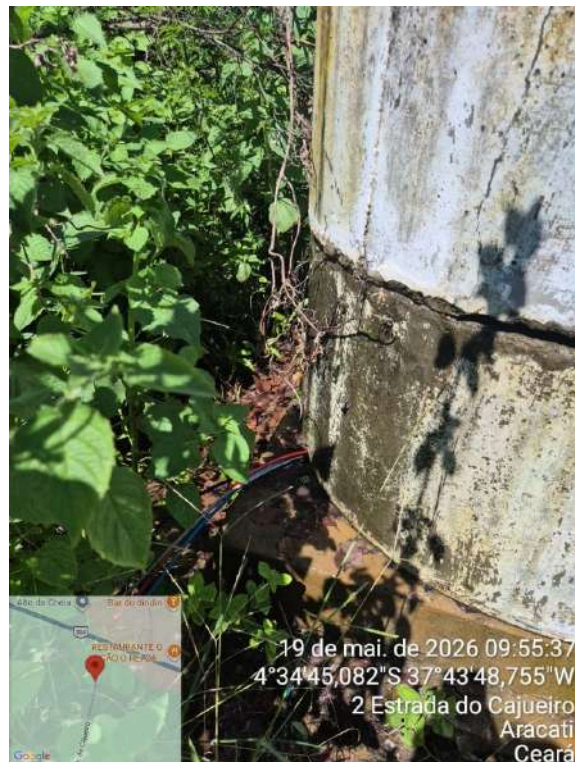
Foto 27 - PT-34 (sede): vazamento intenso no poço, fiação sem proteção.
