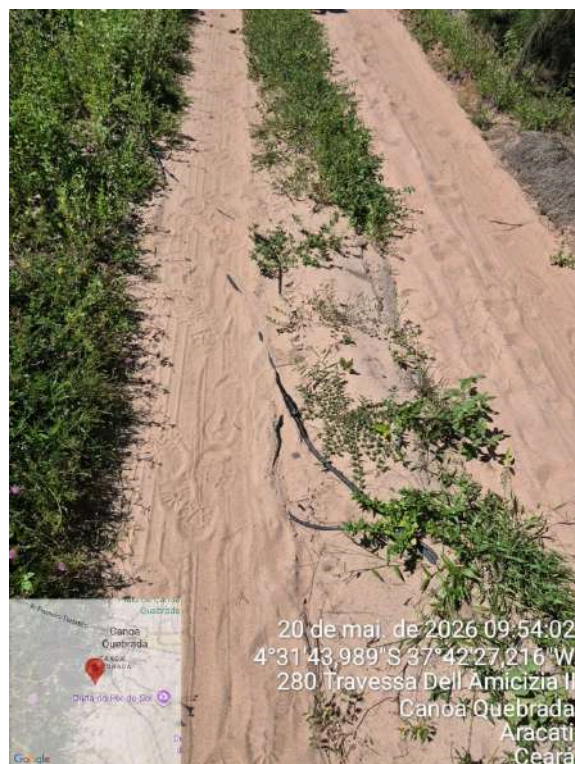
Foto 157 - PT-10 (Canoa): fiação sem proteção e no caminho dos veículos.
