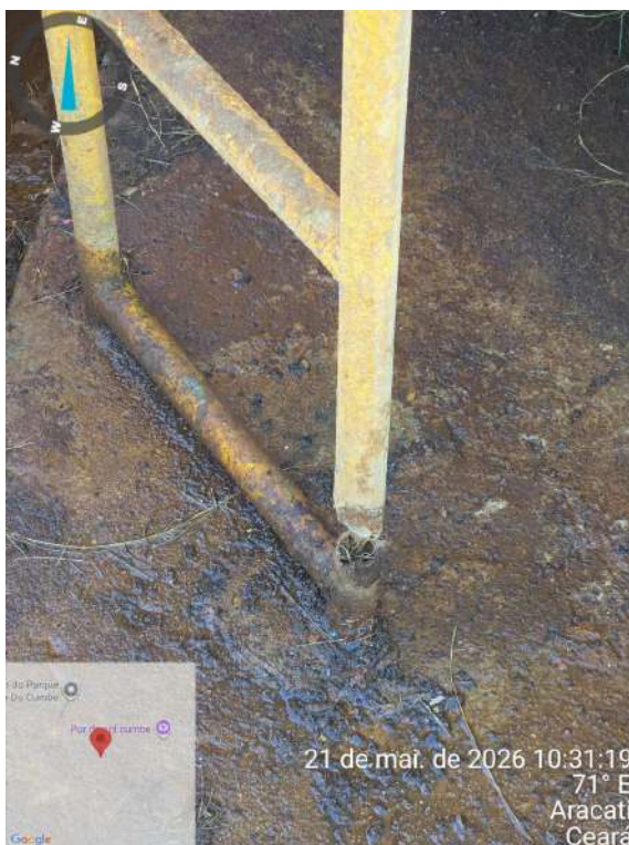
Foto 107 - ETA Cumbe (sede): F-04 com escada danificada.
