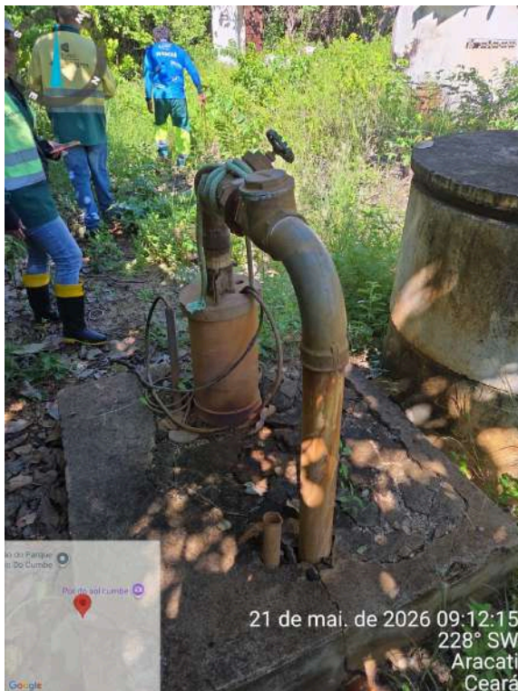
Foto 57 - PT-28 (sede): poço com vazamento e base quebrada.
