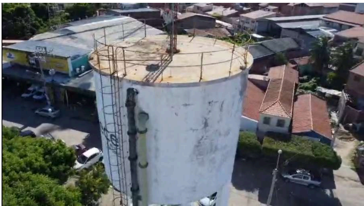
Foto 5 - REL-01 (sede): oxidação no guarda-corpo e na escada.
