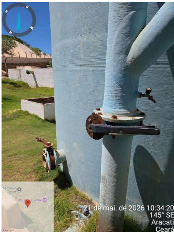
Foto 115 - ETA Cumbe (sede): F-06 com peças oxidadas.
