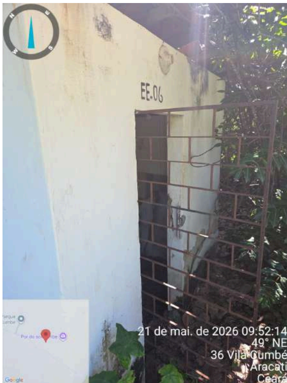
Foto 77 - PT-29 (sede): casa de comando sem lâmpada, porta oxidada, parede desgastada e sinais de infiltração.
