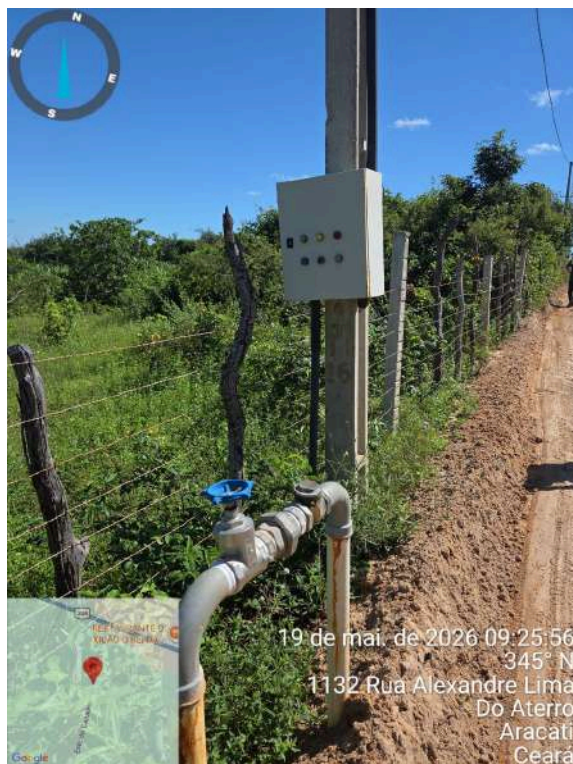
Foto 22 - PT-41 (sede): sem proteção e sem aviso de perigo.
