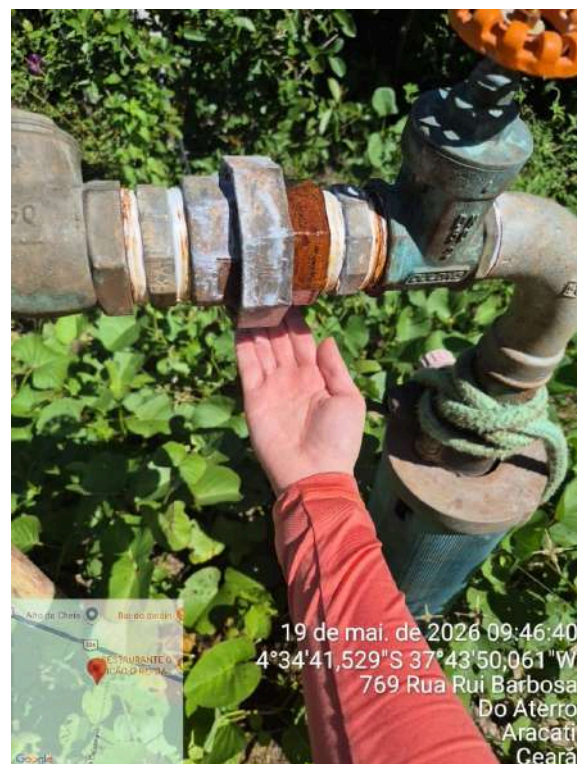
Foto 25 - PT-40 (sede): vazamento na junção, que está oxidada.
