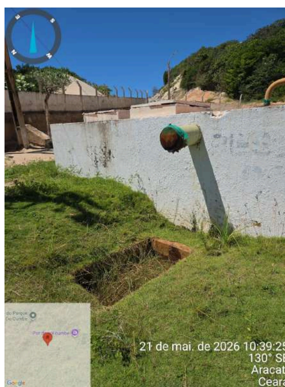
Foto 122 - ETA Cumbe / RAP-02 ( sede ): abertura no piso sem proteção.
