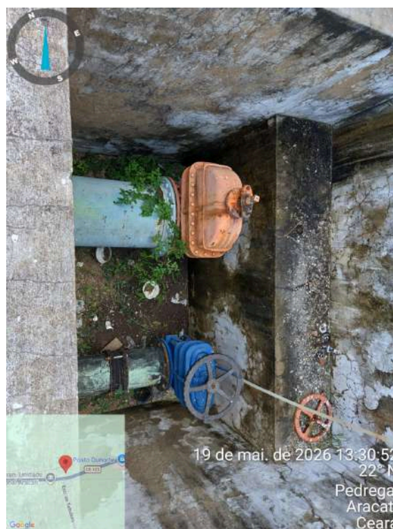
Foto 40 - RAP-04 (sede): válvulas sem proteção na caixa, sem escada e com indícios de vazamento.
