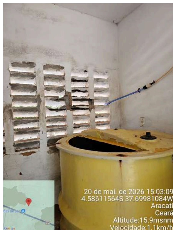
Foto 223 - EEAT-01 (Majorlândia): Casa de Química com cobogós com armadura exposta.
