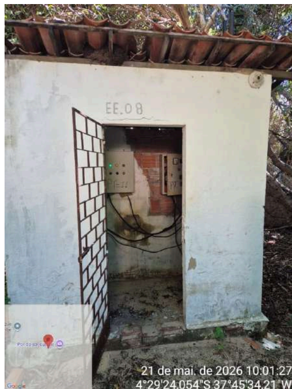
Foto 86 - PT-11 (sede): casa de comando dos PT-10, 11 e 26 com parede desgastada, fiação solta sem proteção.
