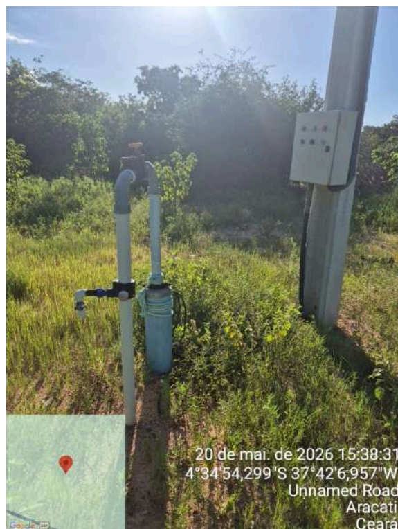
Foto 251 - PT-08 (Majorlândia): sem proteção e identificação, com fiação solta.
