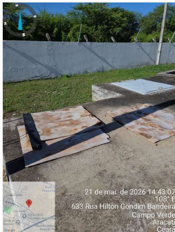
Foto 264 - EEE-A (sede): tampas sem vedação adequada, elevatória com forte odor de efluente.
