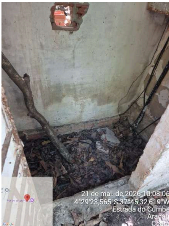
Foto 93 - PT-15 e PT-16 (sede): casa de comando com fiação solta e acúmulo de sujeira.
