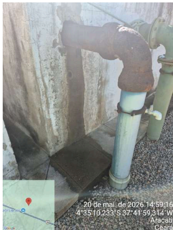
Foto 217 - EEAT-01 (Majorlândia): RSE-01 com tubulação de entrada oxidada e com vazamento.
