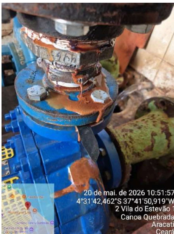
Foto 176 - EEAT-01 (Canoa): bomba com vazamento.
