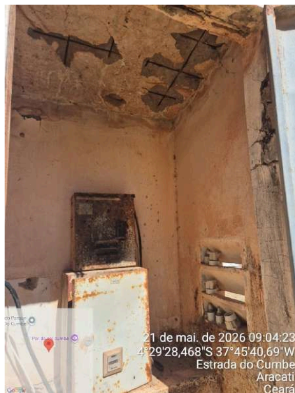
Foto 44 - PT-22 (sede): casa de comando com armadura exposta e risco operacional.
