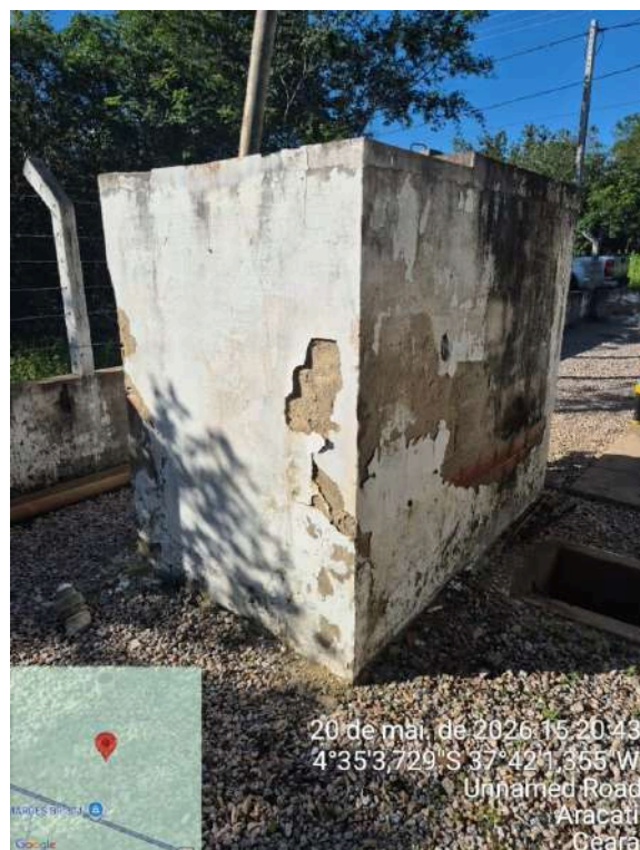
Foto 239 - PT-02 (Majorlândia): parede desgastada.
