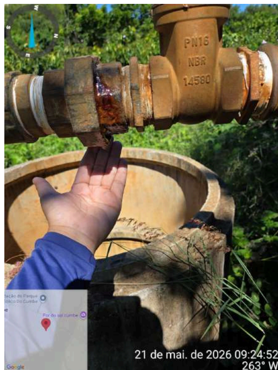
Foto 66 - PT-27(sede): poço com vazamento.
