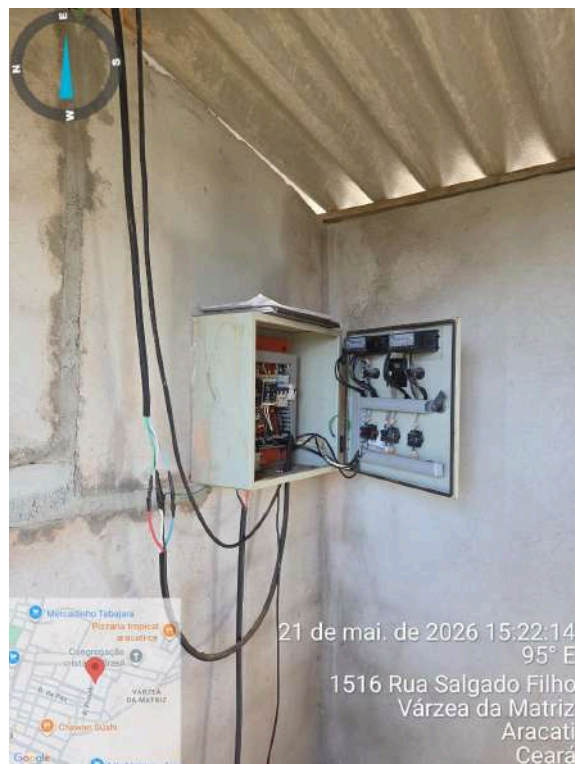
Foto 282 - EEE São Rafael (sede): fiação exposta sem proteção.
