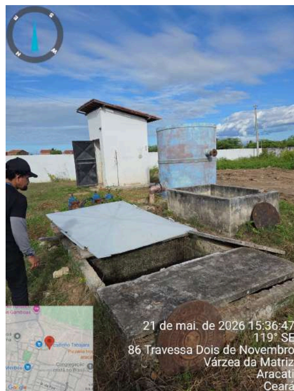
Foto 287 - EEE Tabajaras ( sede ): tampa sem vedação e inadequada.
