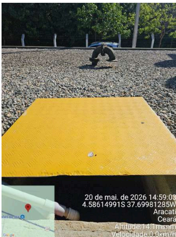
Foto 218 - EEAT-01 (Majorlândia): RSE-01 com tampa aberta e sem proteção no suspiro.
