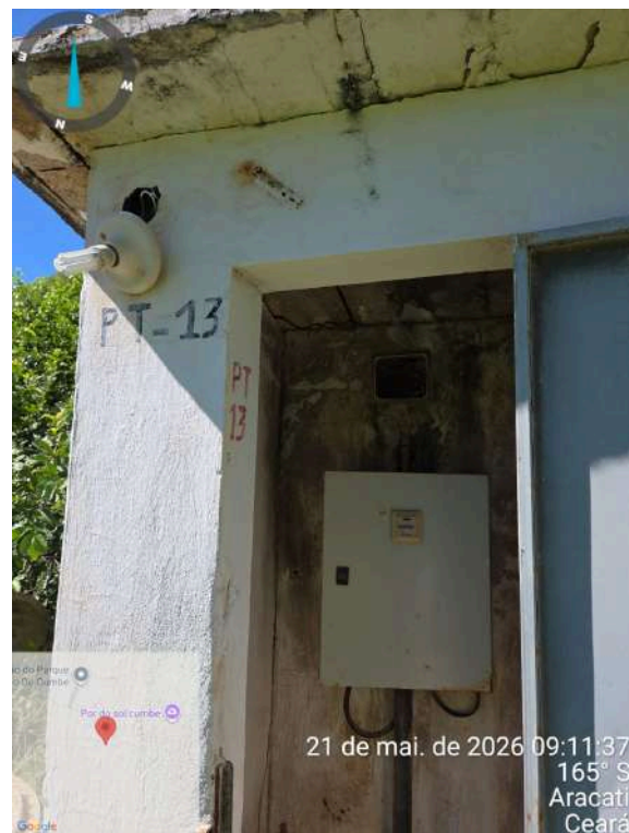
Foto 54 - PT-13 (sede): casa de comando sem lâmpada e teto com armadura exposta.
