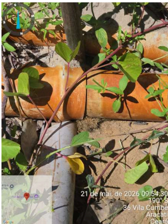
Foto 81 - PT-29 (sede): tubulação próxima ao poço sem encaixe, com sinal de vazamento.
