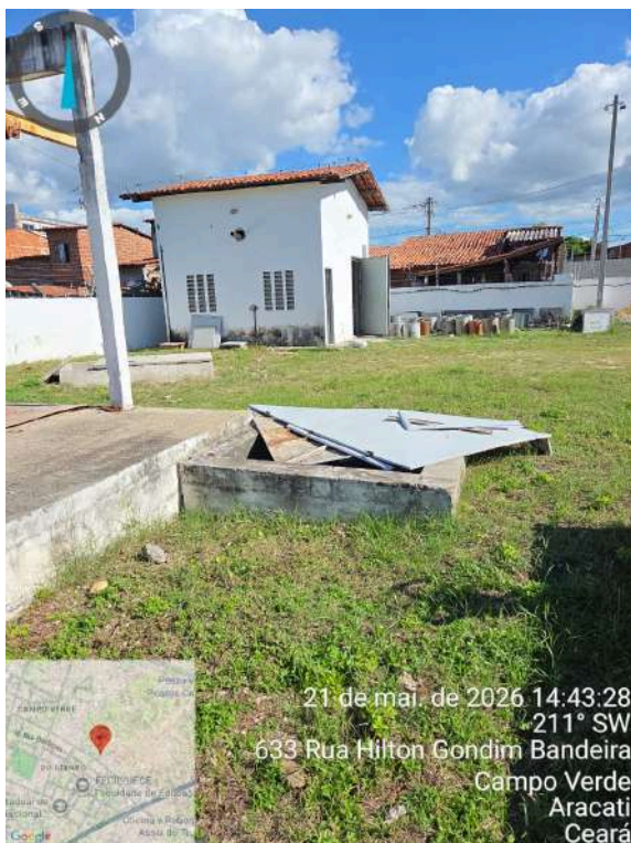
Foto 263 - EEE-A (sede): tampas sem vedação adequada, elevatória com forte odor de efluente.
