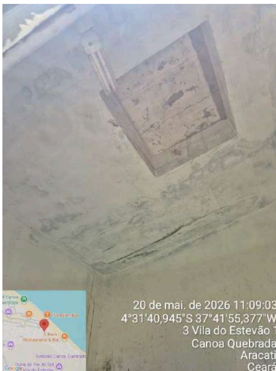
Foto 190 - PT-03 (Canoa): teto com armadura exposta e fissuras.
