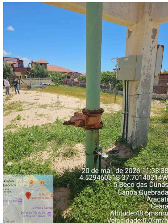
Foto 203 - REL-02 (Canoa): válvula oxidada.
