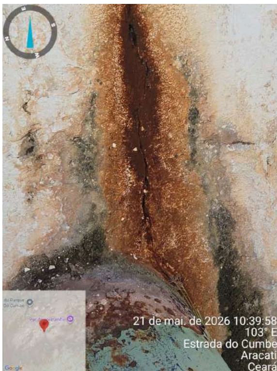
Foto 123 - ETA Cumbe / RAP-02 (sede): parede do reservatório com fissuras, sinais de infiltração e com tubulação oxidada.
