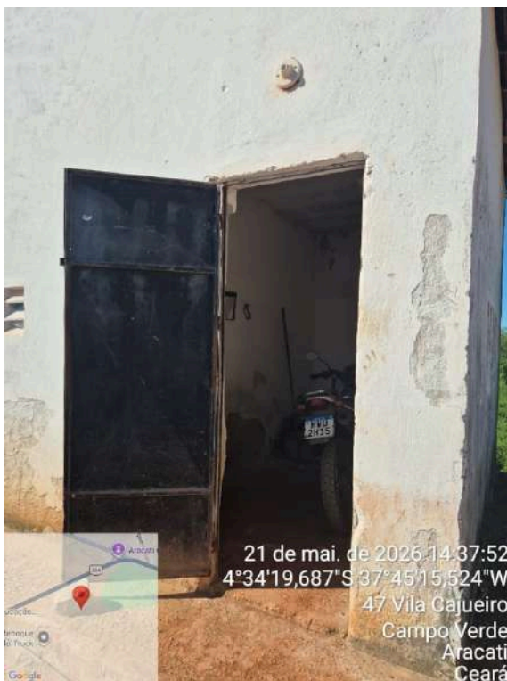
Foto 259 - ETE Aracati: casa de apoio sem iluminação e sem banheiro.
