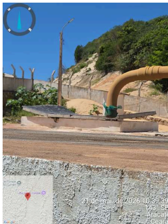
Foto 126 - ETA Cumbe / RAP-02 (sede): tampas sem vedação adequada e desgastadas.
