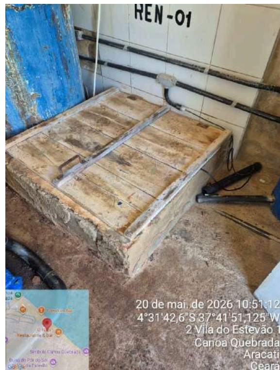
Foto 179 - EEAT-01 (Canoa): REN extravasa quando está cheio, afetando a comunidade do entorno e podendo contribuir para erosão das falésias.
