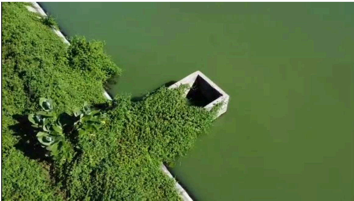
Foto 256 - ETE Aracati: caixa de passagem com vegetação alta.
