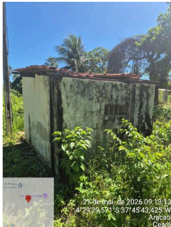
Foto 58 - PT-42 (sede): casa de comando com estrutura desgastada.
