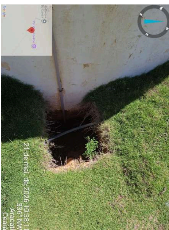
Foto 121 - ETA Cumbe / RAP-01 ( sede ): abertura no piso sem proteção.
