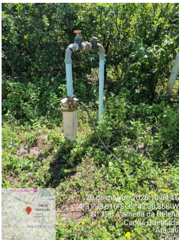
Foto 164 - PT-13 (Canoa): sem identificação e proteção.
