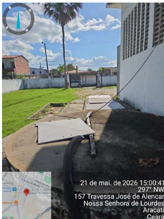
Foto 269 - EEE-B (sede): tampa sem vedação, com apoio inadequado.
