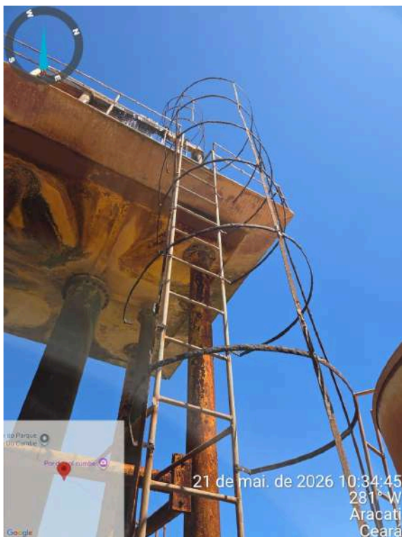
Foto 113 - ETA Cumbe (sede): Aerador com escada com alto nível de oxidação, com guarda-corpo deteriorado.
