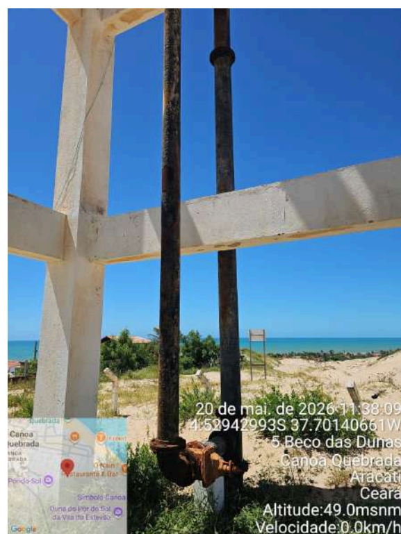
Foto 205 - REL-02 (Canoa): tubulações oxidadas.
