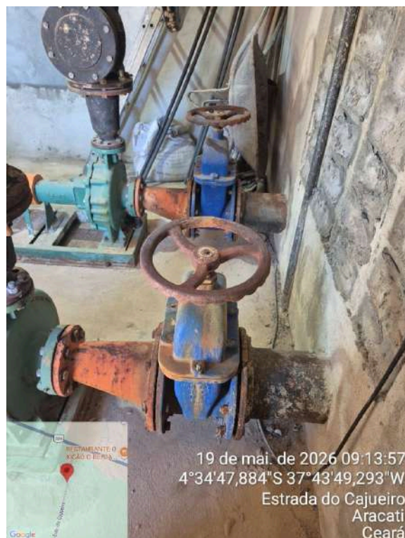
Foto 13 - EEAT-06 (sede): válvulas das bombas oxidadas.
