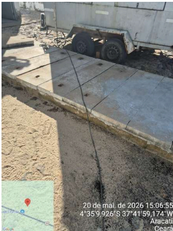
Foto 228 - EEAT-01 (Majorlândia): fiação do gerador inadequada.
