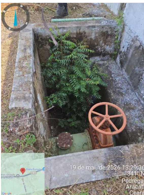
Foto 39 - RAP-04 (sede): válvulas sem proteção na caixa, sem escada e com vegetação.
