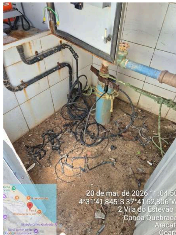
Foto 187 - PT-02 (Canoa): fiação sem proteção, peça oxidada.
