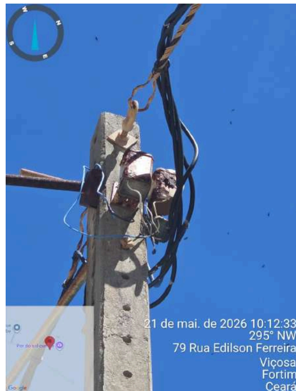
Foto 96 - Área externa (sede): fiação solta sem proteção, apresentando risco operacional.
