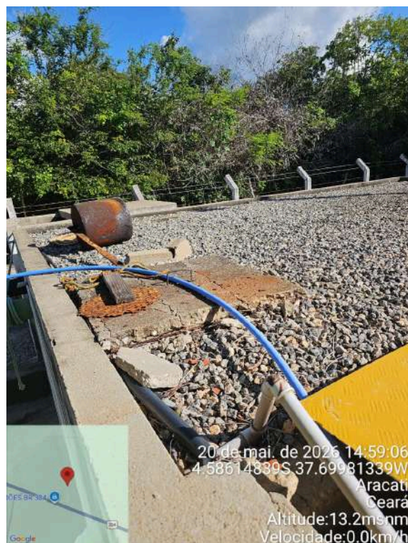
Foto 219 - EEAT-01 (Majorlândia): RSE-01 com material inadequado e oxidado, tampa quebrada.
