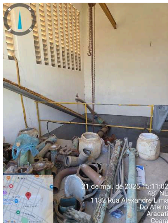
Foto 274 - EEE-D (sede): material de descarte inadequado.
