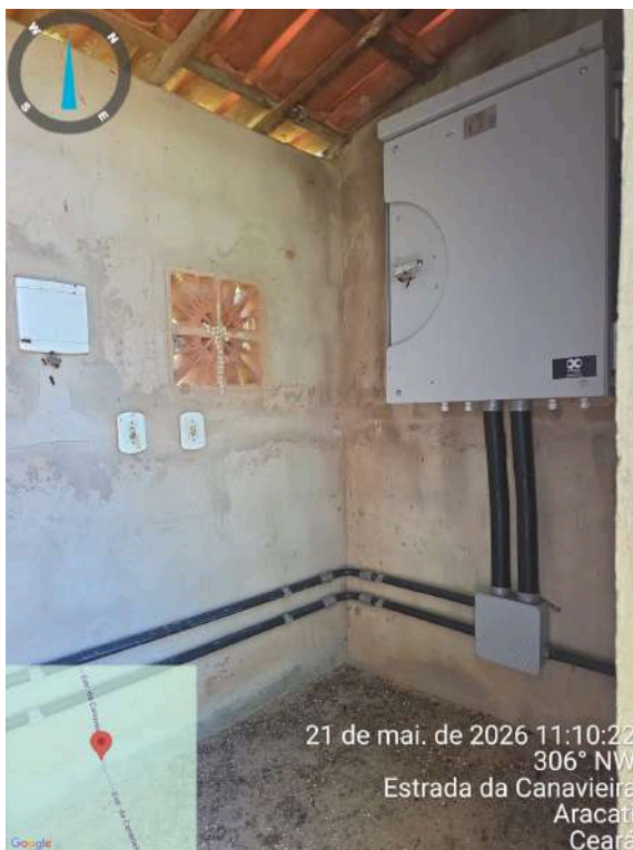
Foto 140 - Booster Canaveira (sede): casa de marimbondo nos painéis, caixa de energia e janela.
