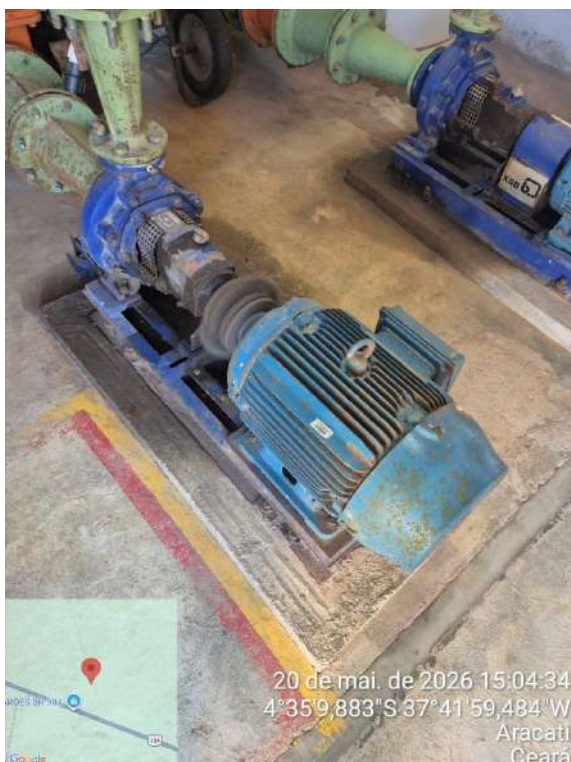
Foto 226 - EEAT-01 (Majorlândia): bomba sem proteção.
