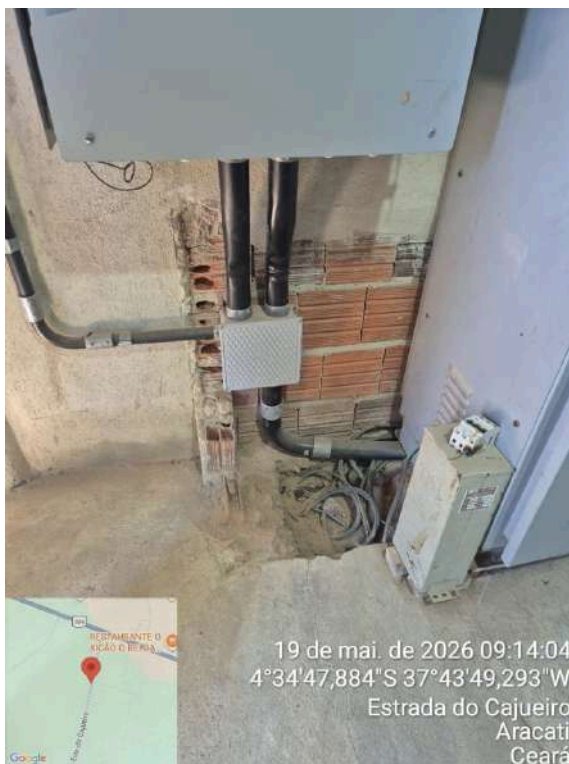
Foto 14 - EEAT-06 (sede): piso quebrado deixando a fiação exposta.
