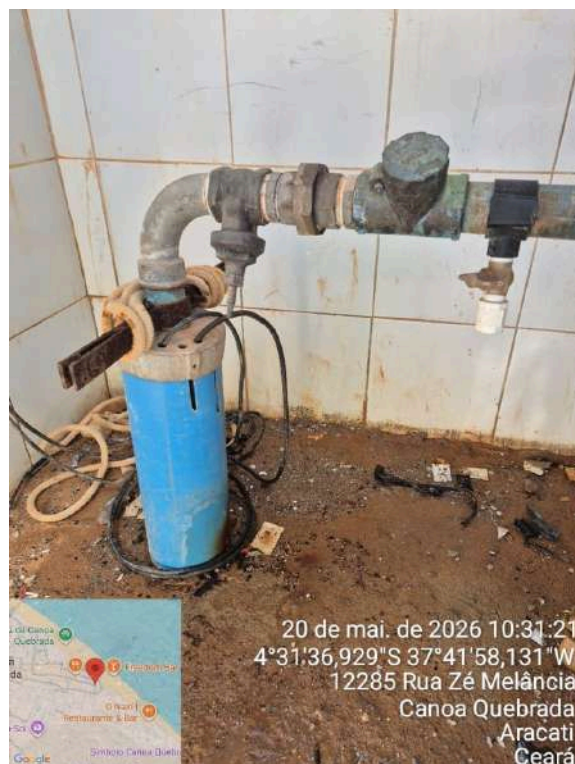
Foto 165 - PT-05 (Canoa): com vazamento, sem identificação.
