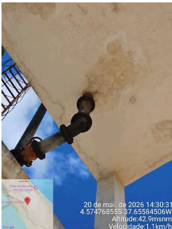
Foto 212 - REL-02 (Quixaba): conexões e tubulações oxidadas, com marcas de infiltração.
