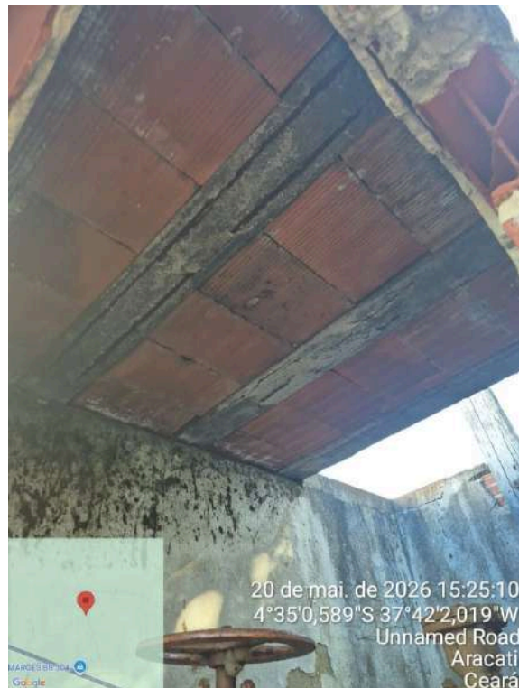
Foto 245 - PT-01 (Majorlândia): armadura exposta na casa do poço.
