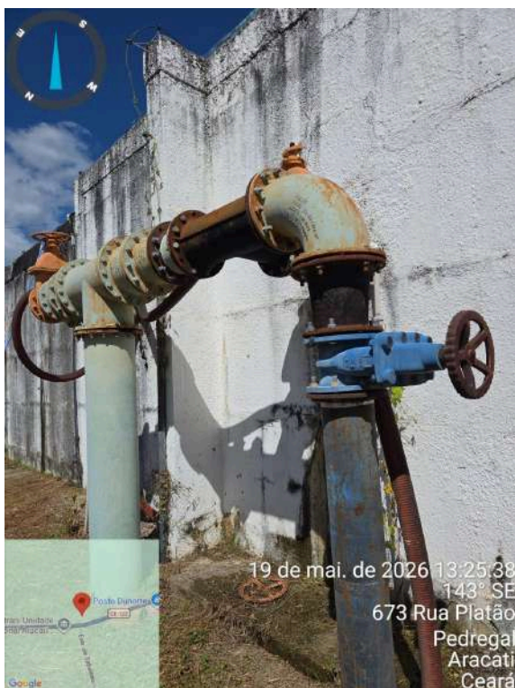
Foto 32 - RAP-04 (sede): tubulação, válvula e junções oxidados.
