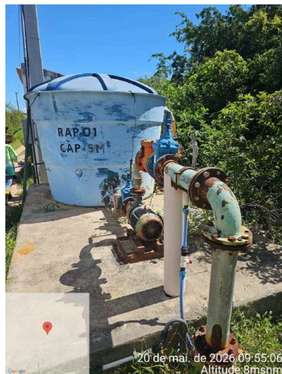
Foto 153 - EEAT-02 (Canoa): bomba e tubulações com oxidação.
