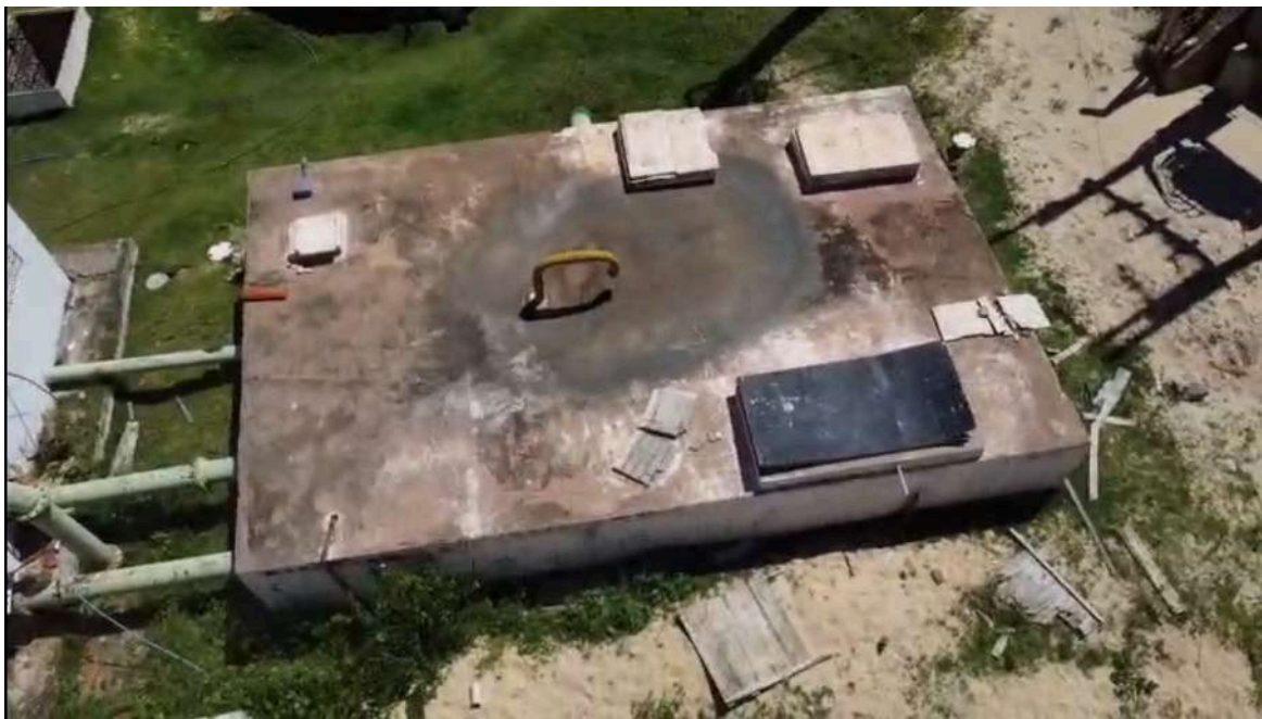
Foto 127 - ETA Cumbe / RAP-02 ( sede ): tampas sem vedação adequada e desgastadas.
