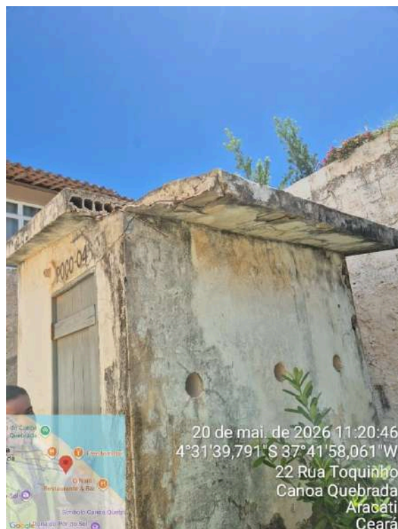
Foto 197 - PT-04 (Canoa): teto com armadura exposta e parcialmente quebrado.
