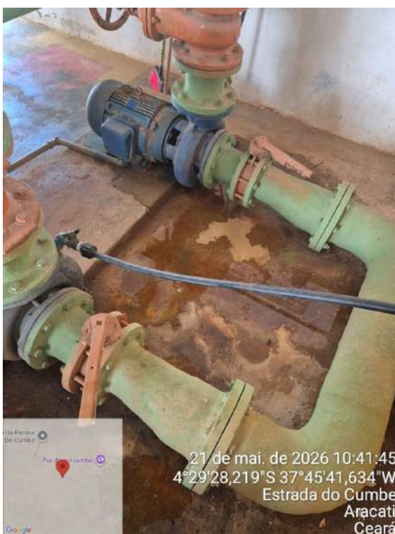
Foto 128 - ETA Cumbe / Casa de bombas ( sede ): sem calhas de escoamento da água.
