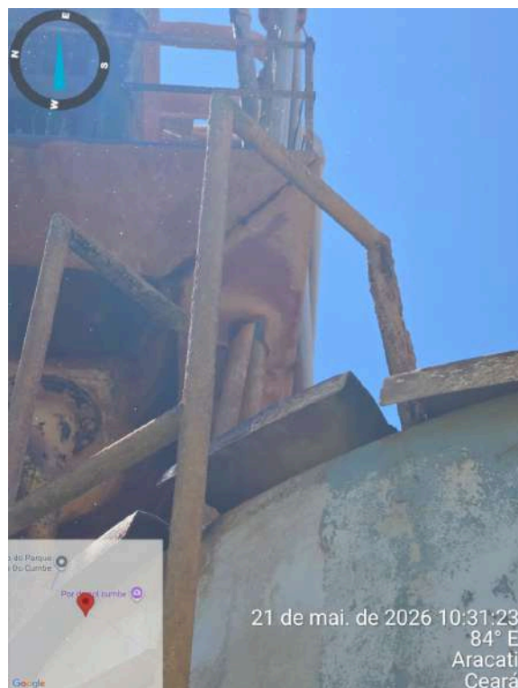
Foto 108 - ETA Cumbe (sede): F-04 com escada danificada.
