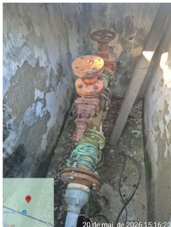
Foto 235 - PT-03 (Majorlândia): tubulação oxidada.
