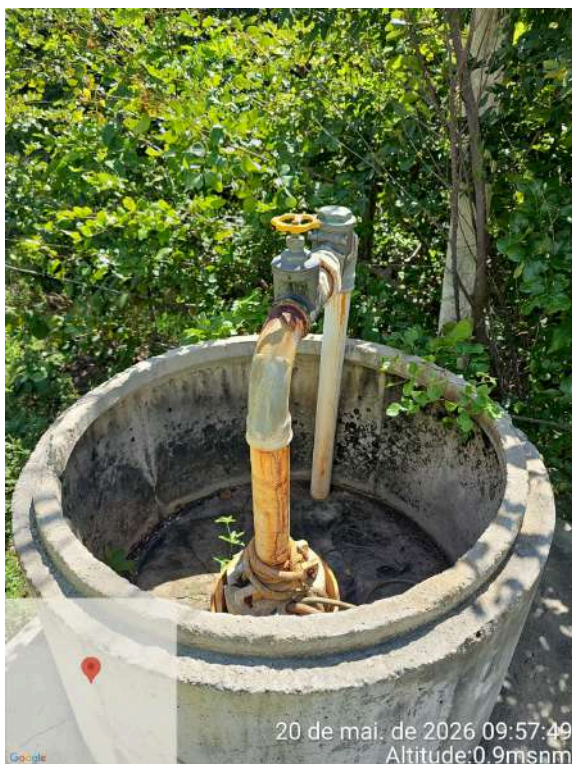
Foto 158 - PT-08 (Canoa): sem proteção completa do poço.
