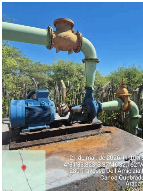
Foto 143 - Booster Canaveira (sede): bomba sem caixa de proteção, válvulas oxidadas.
