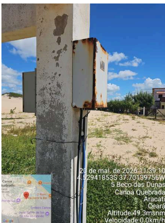
Foto 204 - REL-02 (Canoa): painel oxidado.
