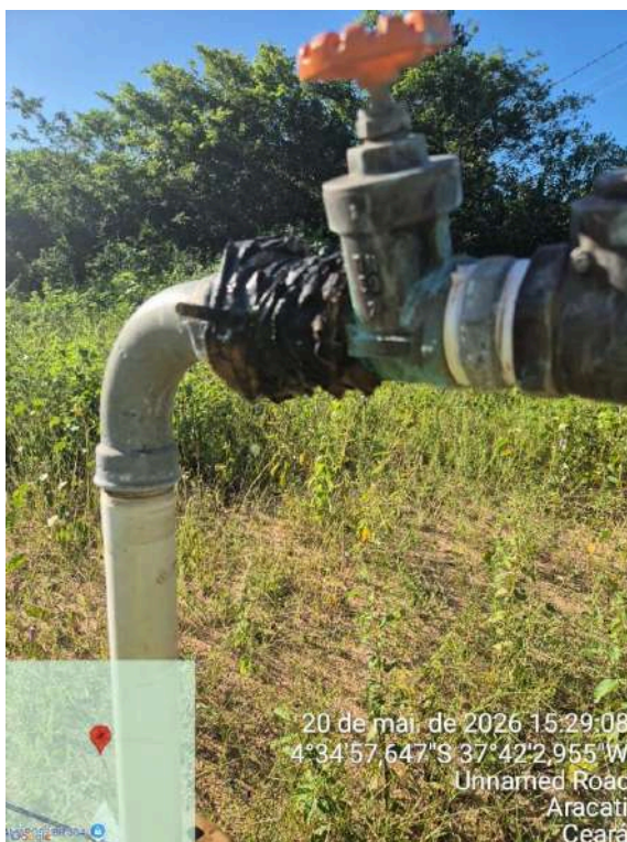
Foto 246 - PT-06 (Majorlândia): poço com vazamento e sem proteção e identificação.
