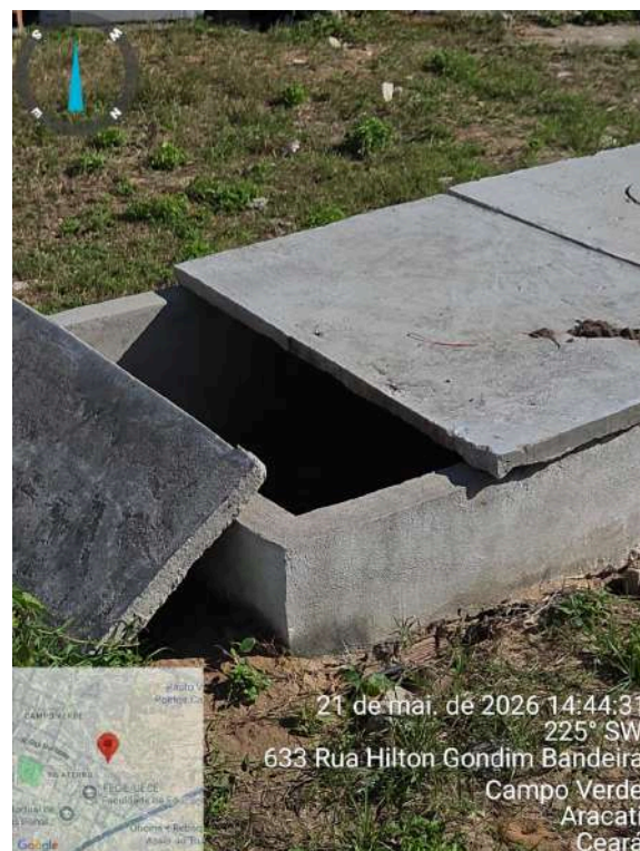
Foto 262 - ETE-A (sede): tampas pesadas de difícil manuseio pela operação.
