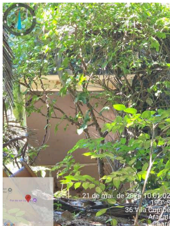
Foto 84 - PT desativado (sede): estrutura antiga abandonada.
