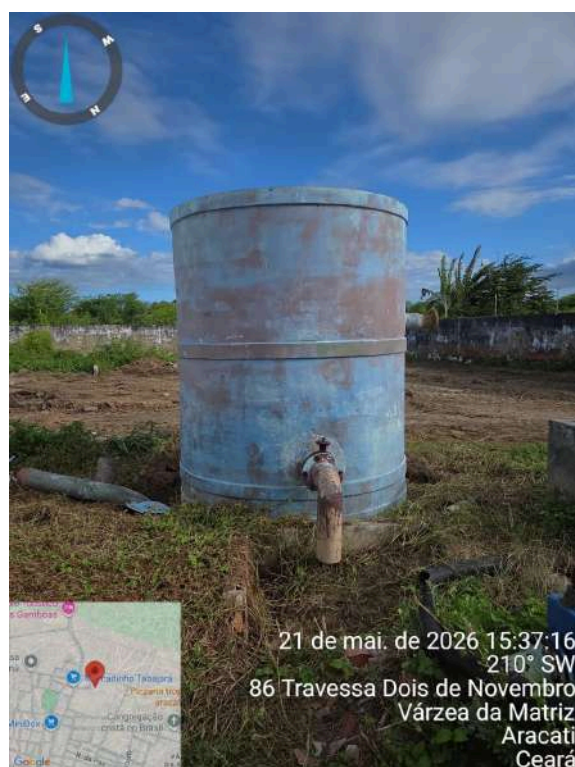
Foto 284 - EEE Tabajaras (sede): decanto digestor desativado, há 13 anos sem remoção.
