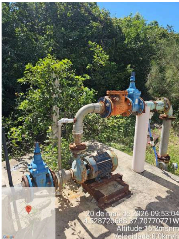
Foto 154 - EEAT-02 (Canoa): bomba e tubulações com oxidação.
