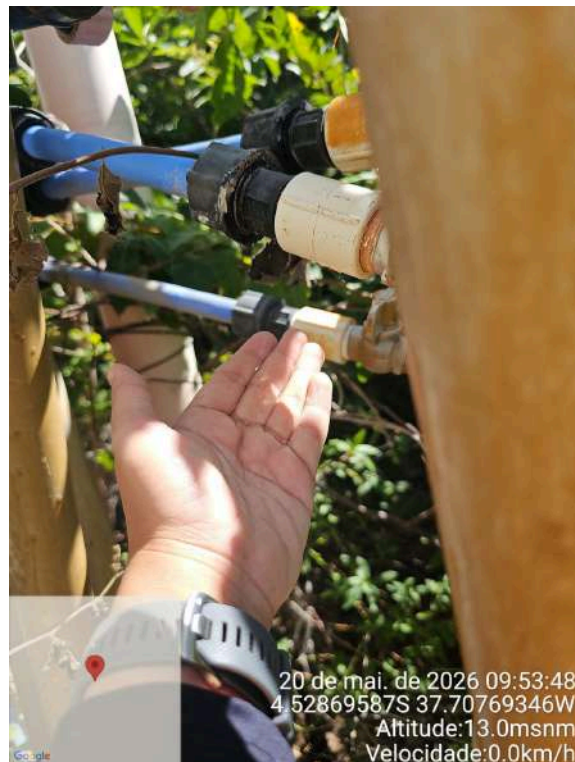
Foto 155 - EEAT-02 (Canoa): vazamento no registro do RAP-01.
