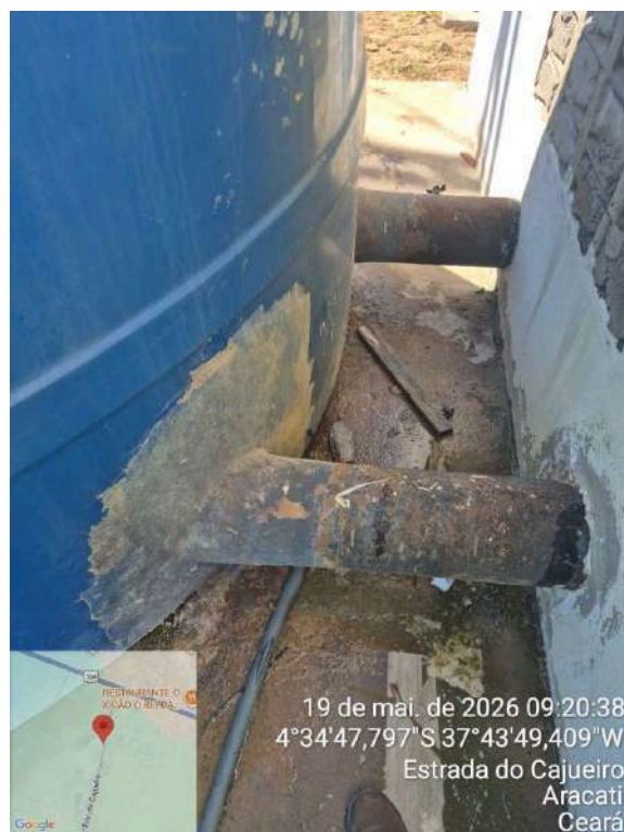
Foto 21 - RAP-06 (sede): tubulação desgastada.
