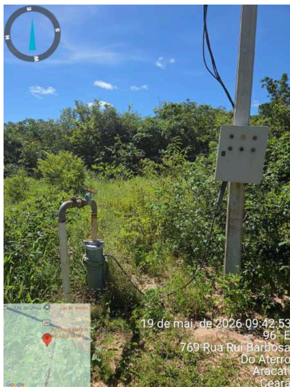
Foto 24 - PT-38 (sede): sem identificação e com fiação solta.
