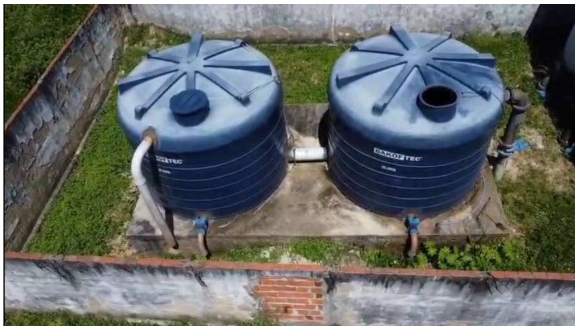
Foto 149 - Booster BR (sede): RAP com tampa aberta.
