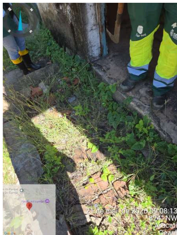
Foto 52 - Casa de comando PT-03 e PT-28 (sede): patamar de acesso quebrado.
