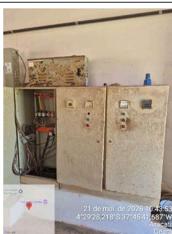
Foto 131 - ETA Cumbe / Casa de bombas (sede): painéis oxidados.
