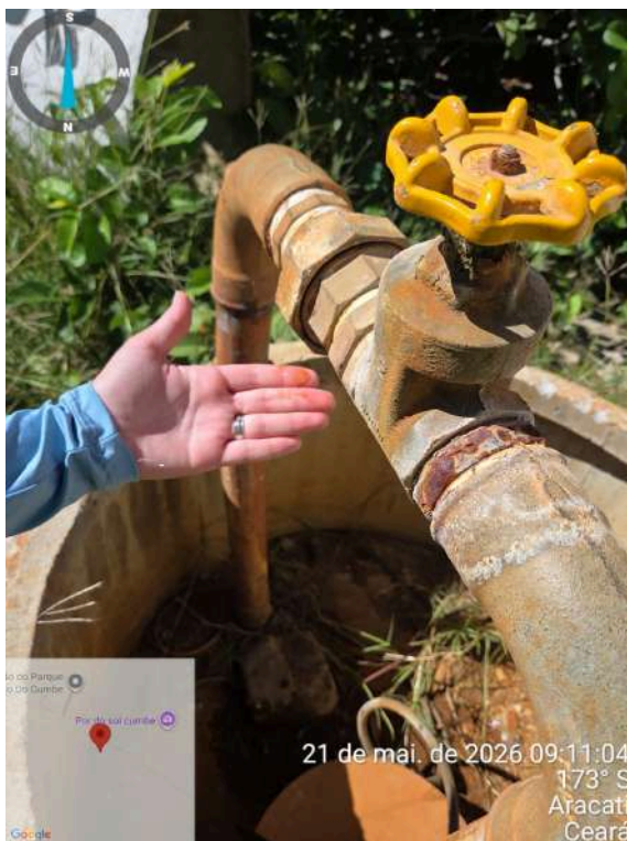
Foto 53 - PT-13 (sede): junção com vazamento e sem anel de proteção completo.
