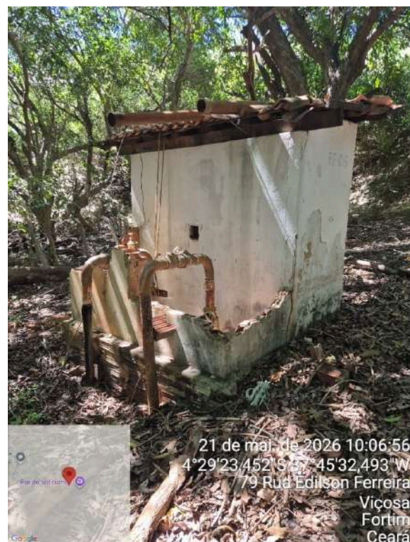
Foto 92 - PT-15 e PT-16 (sede): casa de comando e poços com estrutura danificada.
