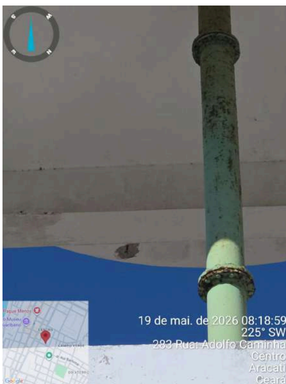
Foto 3 - REL-01 (sede): armadura exposta e oxidação na tubulação.
