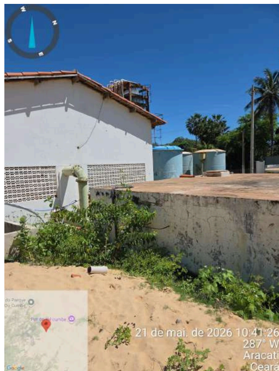
Foto 124 - ETA Cumbe / RAP-02 (sede): escada de acesso oxidada e coberta por vegetação, com parede do RAP desgastada.
