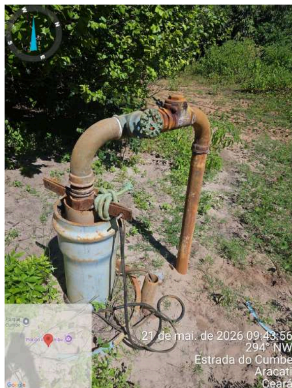
Foto 72 - PT-43 (sede): tubulação oxidada e fiação sem proteção.
