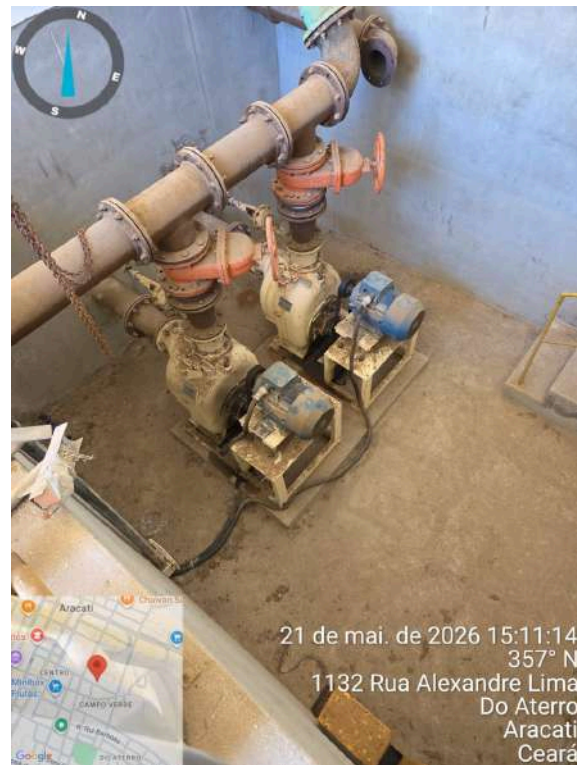
Foto 272 - EEE-D (sede): área das bombas com sujeira.
