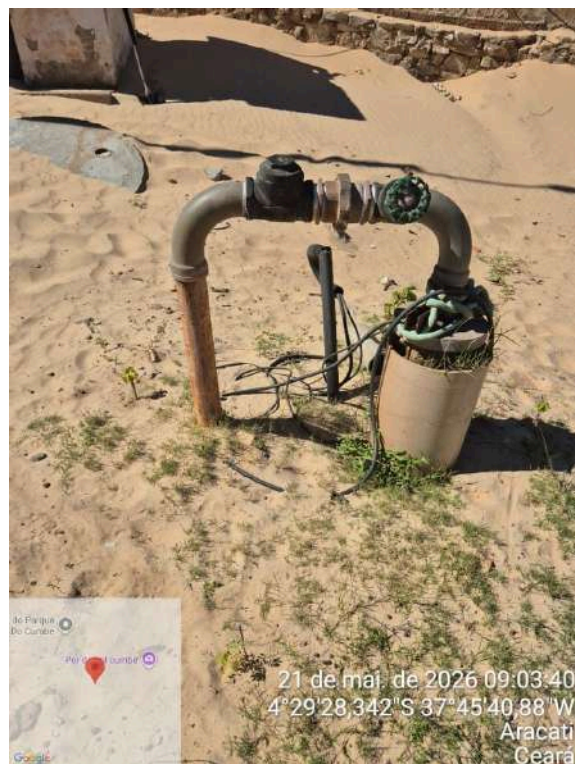
Foto 46 - PT-22 (sede): poço e fiação sem proteção.
