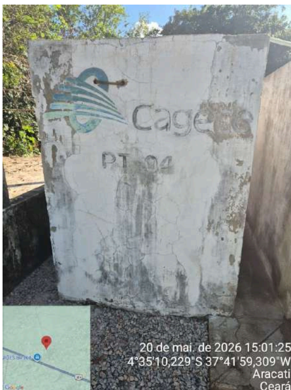
Foto 230 - PT-04 (Majorlândia): poço sem escada, difícil acesso.
