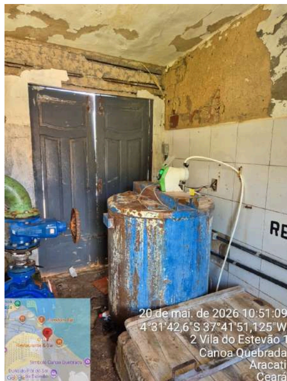
Foto 171 - EEAT-01 (Canoa): teto com armadura completamente exposta, paredes desgastadas.
