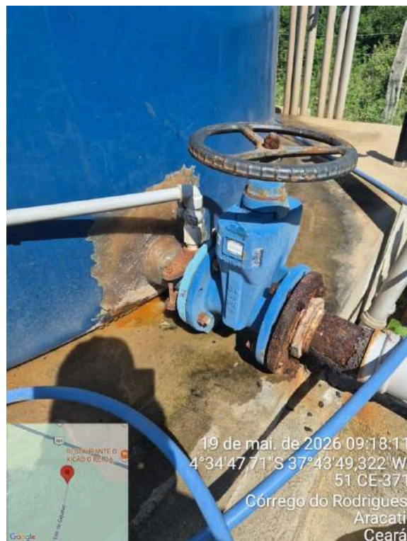
Foto 19 - RAP-06 (sede): válvula oxidada.
