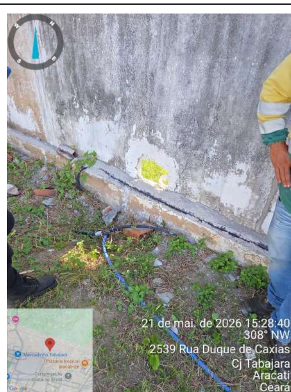
Foto 277 - EEE-G (sede): muro com abertura inadequada.
