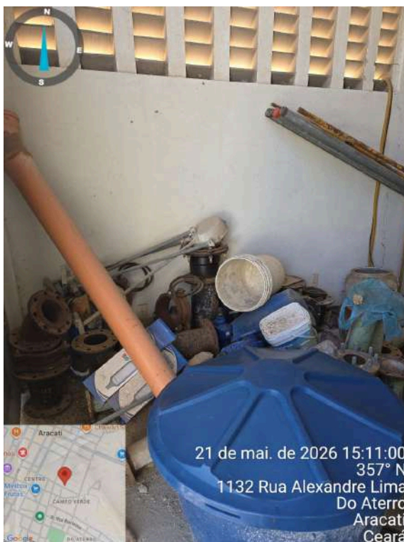
Foto 273 - EEE-D (sede): material de descarte armazenado inadequadamente.
