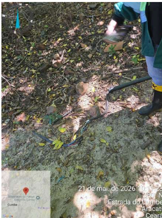
Foto 95 - Área externa (sede): fiação solta sem proteção, apresentando risco operacional.
