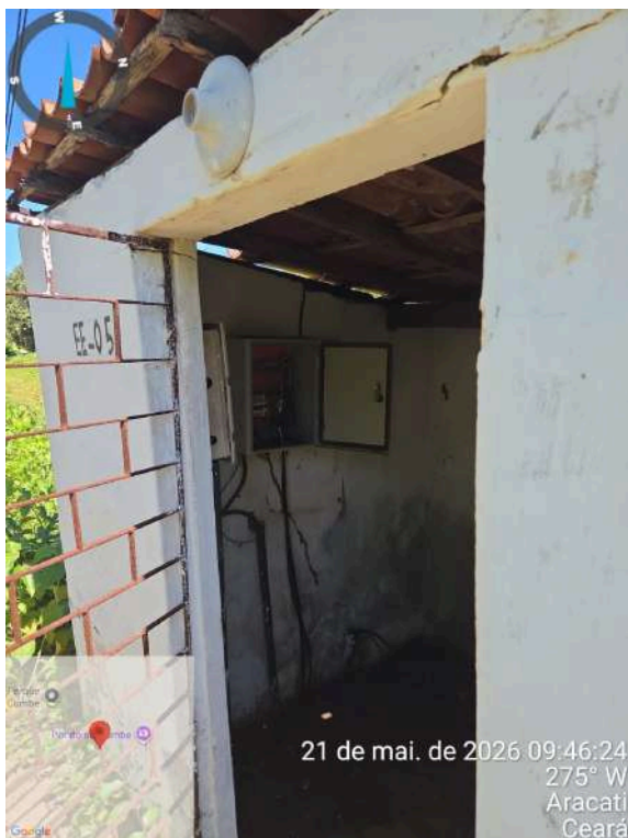
Foto 73 - PT-43 (sede): casa de comando sem iluminação, fiação solta e casa de maribondo.
