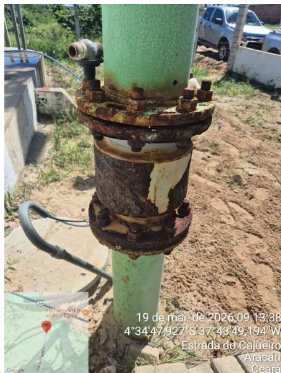
Foto 11 - EEAT-06 (sede): válvula com oxidação avançada.
