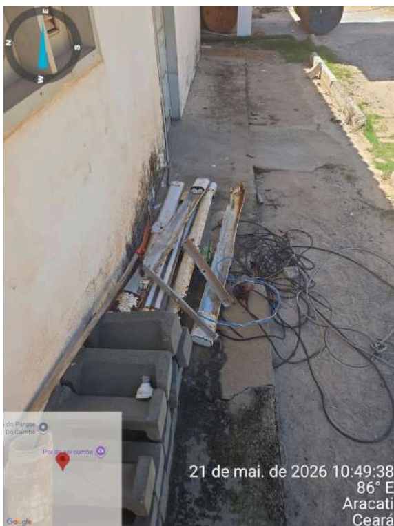
Foto 134 - ETA Cumbe / Casa de apoio (sede): material de descarte inadequado.
