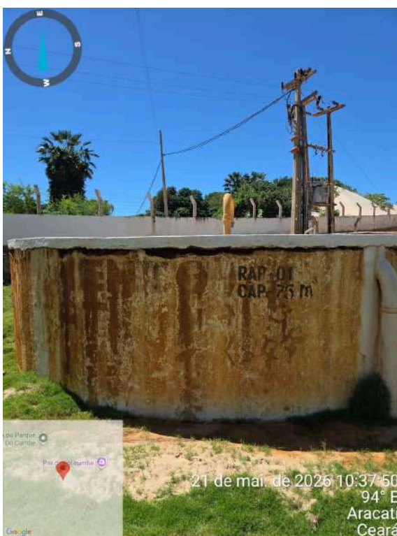
Foto 118 - ETA Cumbe / RAP-01 (sede): parede com indícios de ferro, desgastada.
