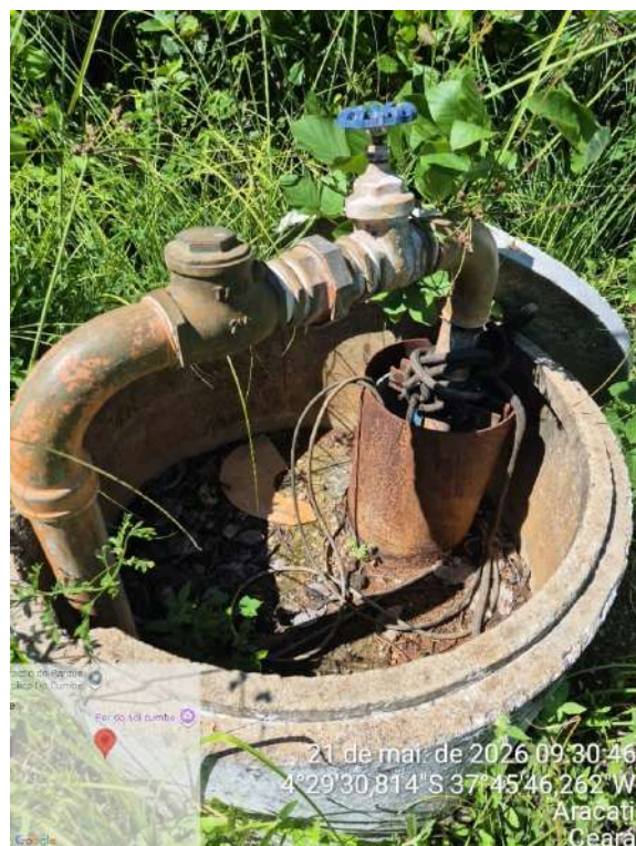
Foto 68 - PT-23 (sede): tubulação oxidada.
