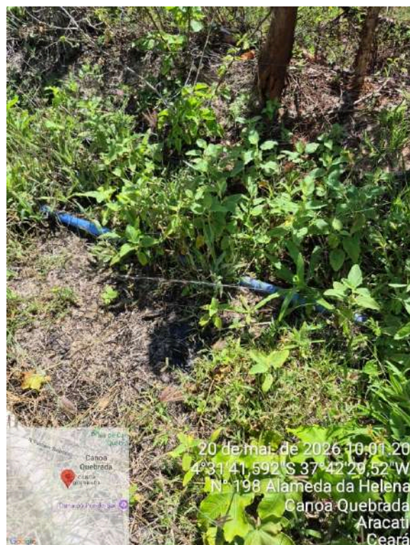
Foto 161 - PT-09 (Canoa): vazamento na mangueira próxima ao poço.
