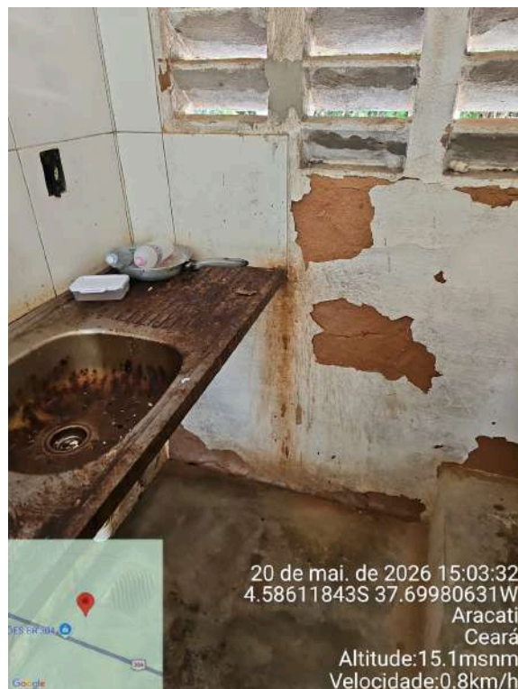
Foto 225 - EEAT-01 (Majorlândia): Casa de Química com pia oxidada e parede desgastada.
