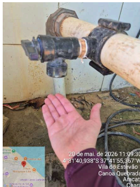
Foto 193 - PT-03 (Canoa): válvula com vazamento.
