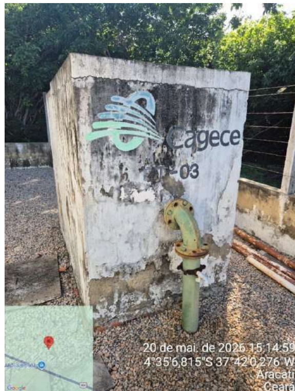
Foto 233 - PT-03 (Majorlândia): sem escada de acesso, parede desgastada.
