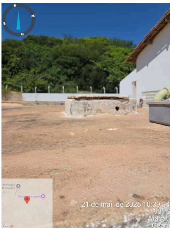
Foto 125 - ETA Cumbe / RAP-02 (sede): tampas sem vedação adequada e desgastadas.
