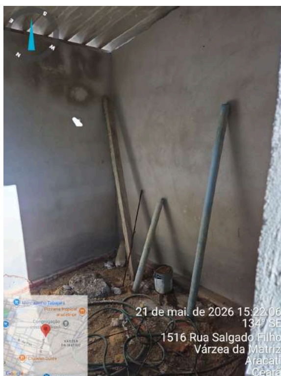
Foto 283 - EEE São Rafael (sede): fiação solta com disposição de material inadequado.
