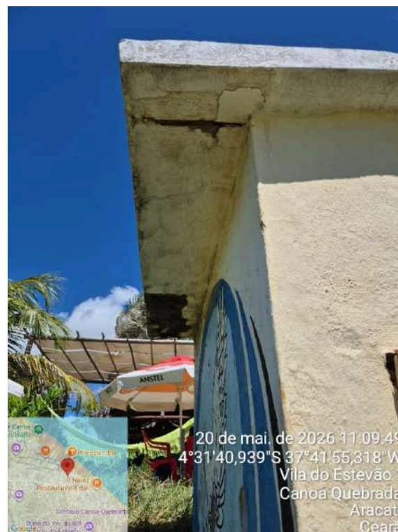
Foto 189 - PT-03 (Canoa): teto com armadura exposta e fissuras.
