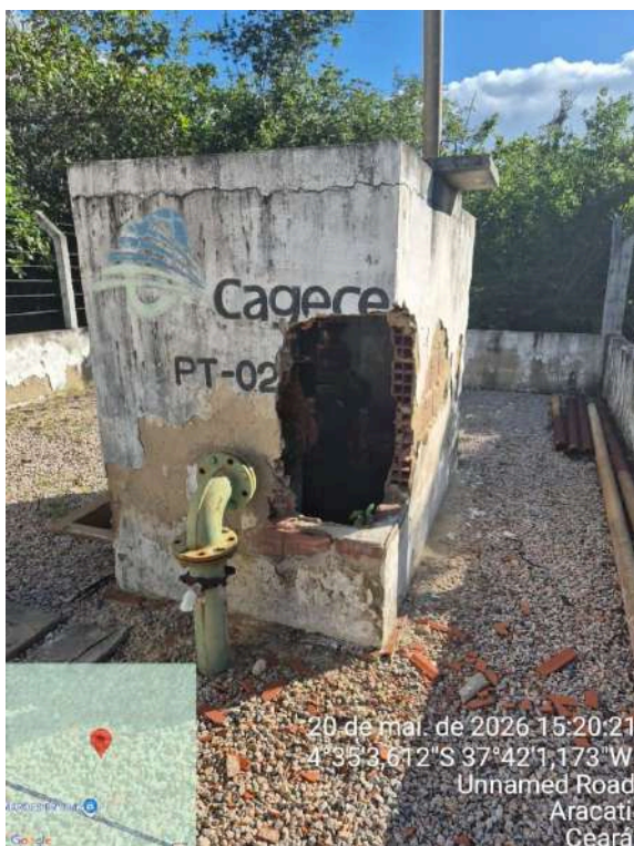
Foto 238 - PT-02 (Majorlândia): caixa do poço quebrada devido a dificuldade de acesso.
