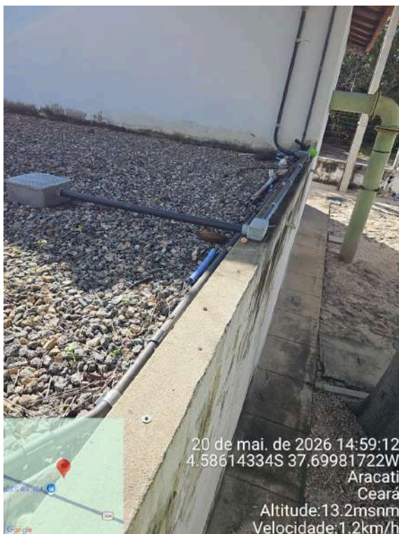
Foto 220 - EEAT-01 (Majorlândia): parede do RSE-01 desgastada.
