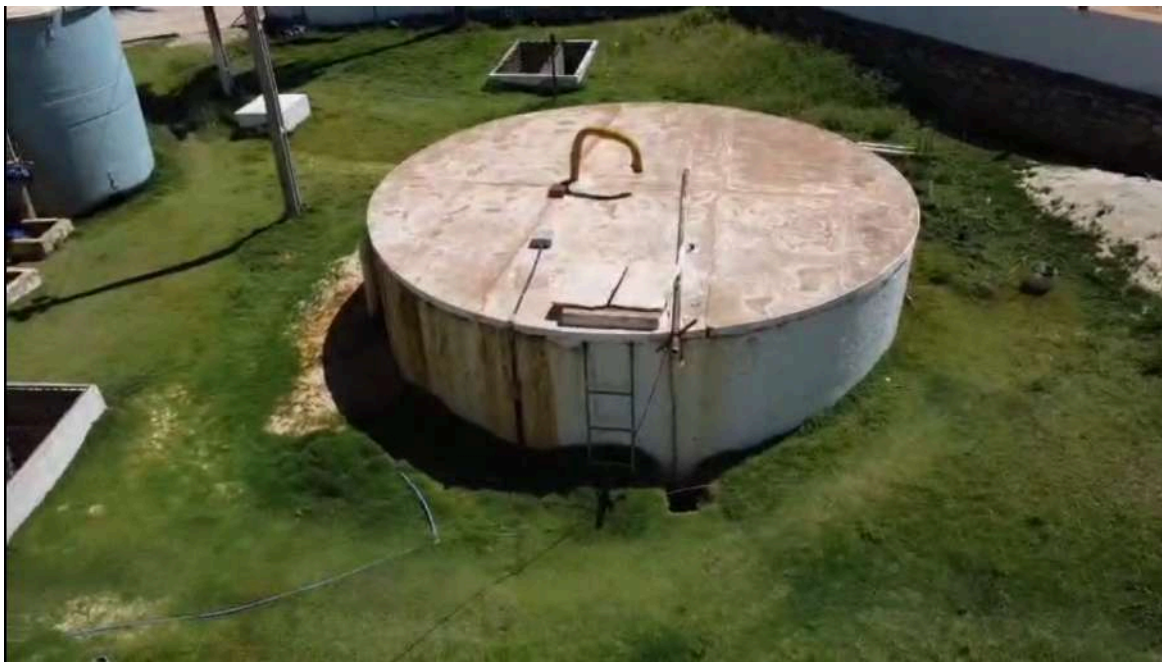
Foto 120 - ETA Cumbe / RAP-01 ( sede ): tampa quebrada, parcialmente aberta, escada oxidada.
