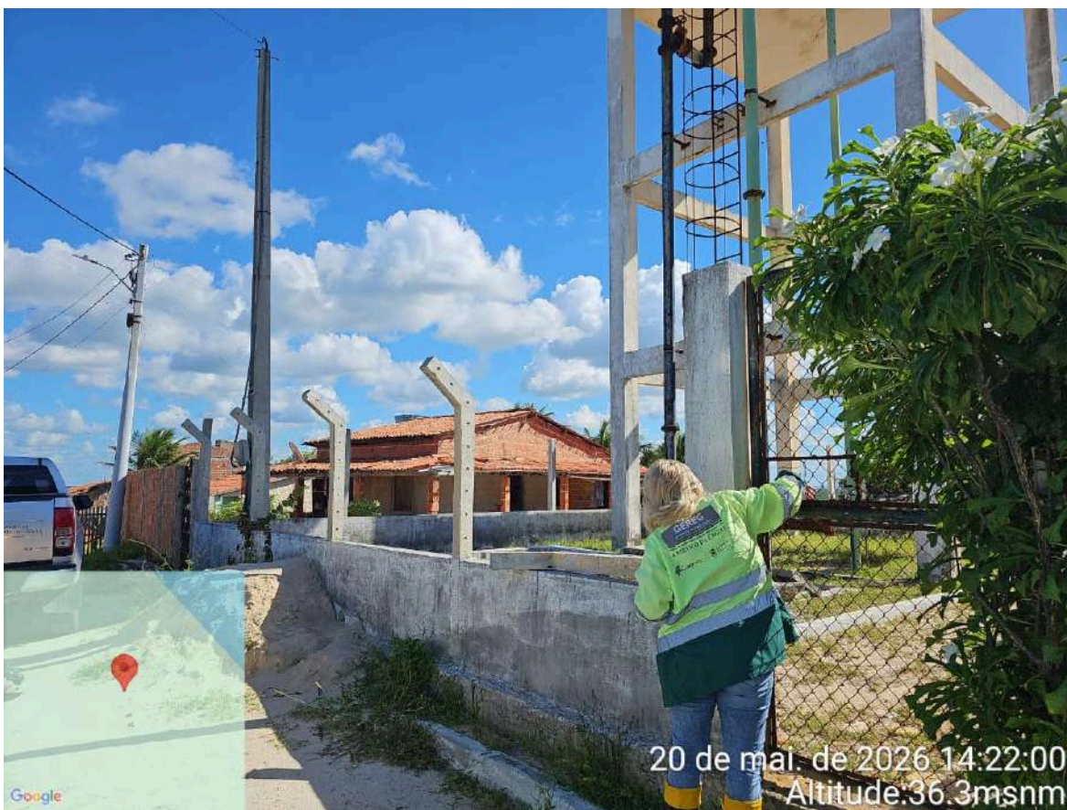
Foto 211 - REL-02 (Quixaba): cerca sem arame, sem identificação, portão oxidado travado.
