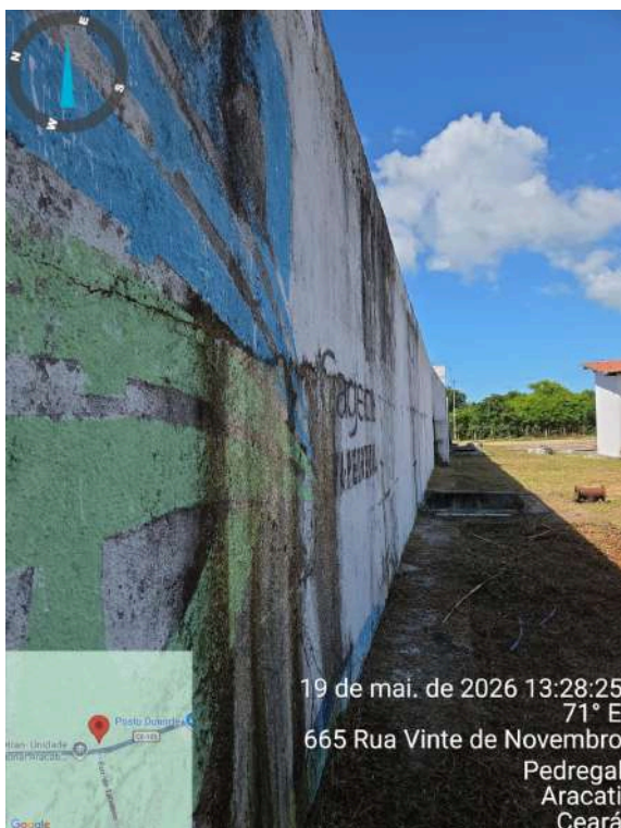
Foto 36 - RAP-04 (sede): muitos pontos de vazamento e infiltração nas paredes do reservatório.
