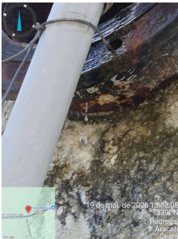
Foto 41 - RAP-04 (sede): extravasor com oxidação e vazamento.
