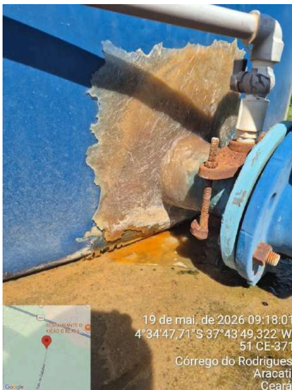
Foto 18 - RAP-06 (sede): vazamento na fibra.
