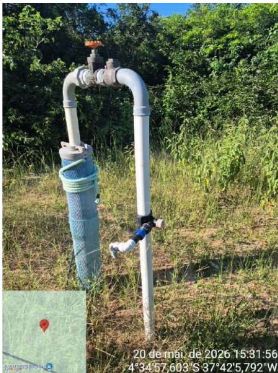
Foto 248 - PT-05 (Majorlândia): sem proteção.
