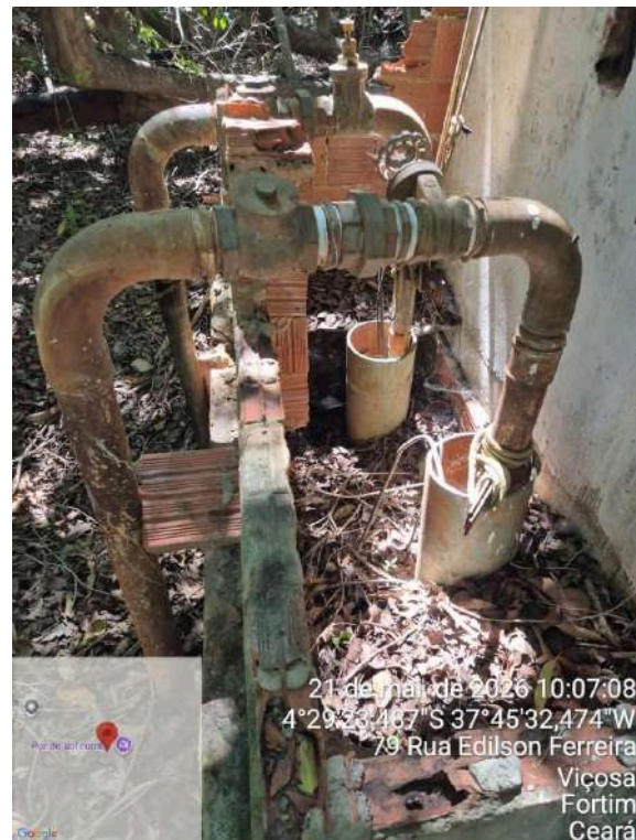
Foto 94 - PT-15 e PT-16 (sede): poços com tubulação desgastada, sujeira e casa de marimbondo.
