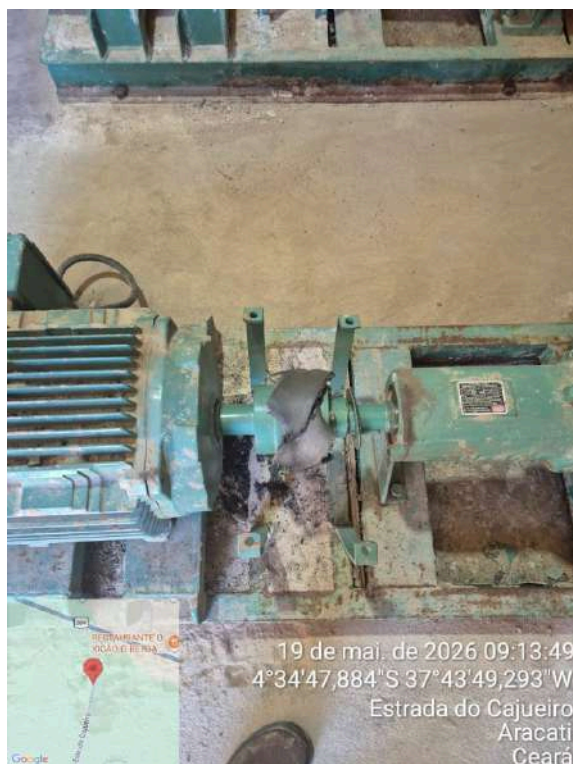
Foto 12 - EEAT-06 (sede): bomba sem proteção.
