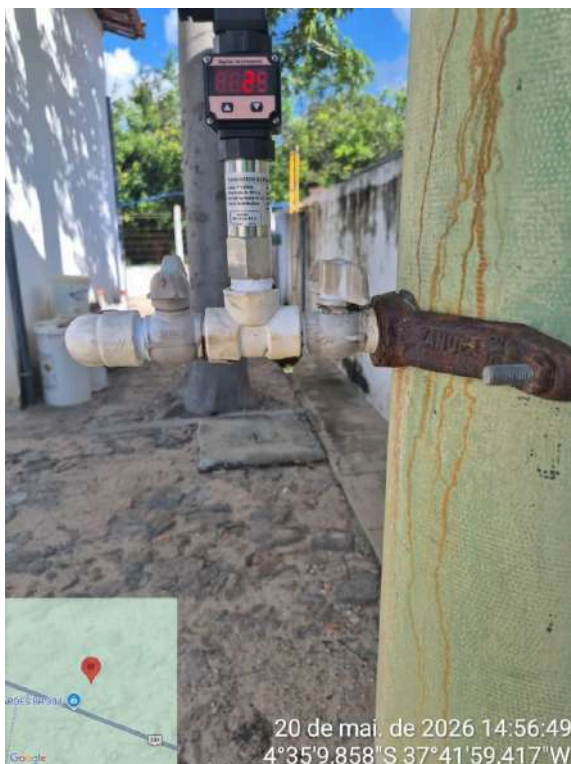
Foto 216 - EEAT-01 (Majorlândia): mangual oxidado e junção com vazamento.
