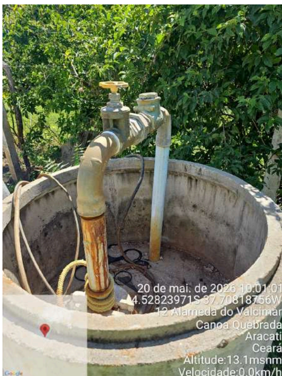
Foto 160 - PT-09 (Canoa): sem proteção completa do poço.
