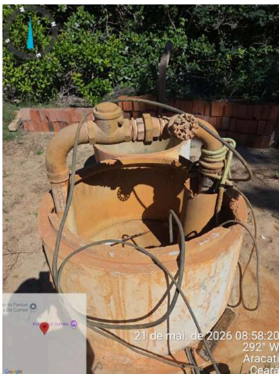
Foto 43 - PT-30 (sede): fiação inadequada.
