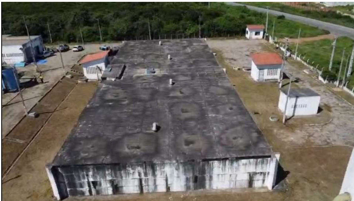
Foto 38 - RAP-04 (sede): pontos de infiltração na parte superior do reservatório.
