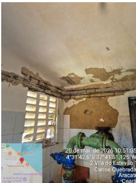
Foto 172 - EEAT-01 (Canoa): teto com armadura completamente exposta, paredes desgastadas.
