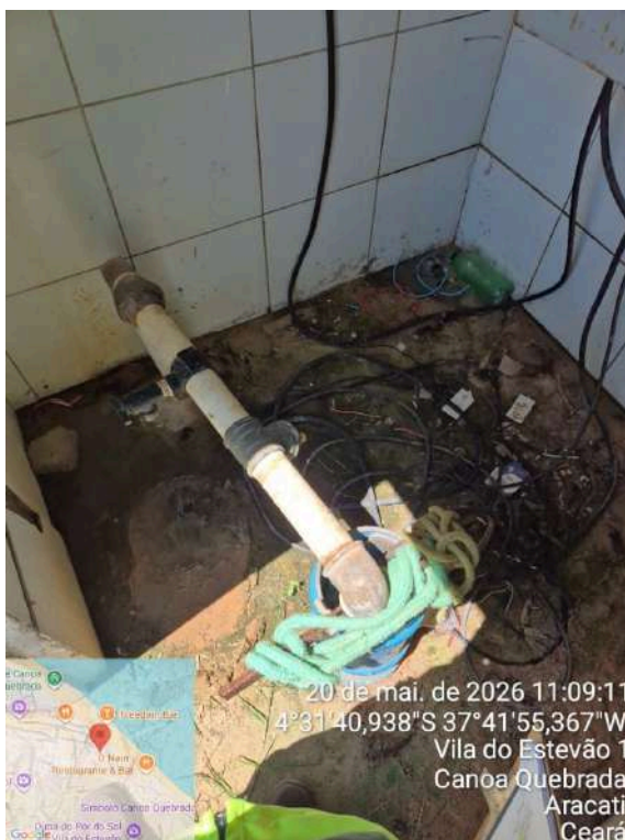
Foto 192 - PT-03 (Canoa): fiação sem proteção.
