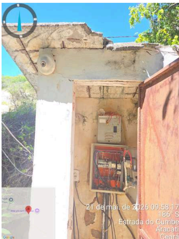
Foto 83 - PT-18 (sede): teto com armadura exposta, porta oxidada, sem lâmpada, fiação sem proteção, parede desgastada.
