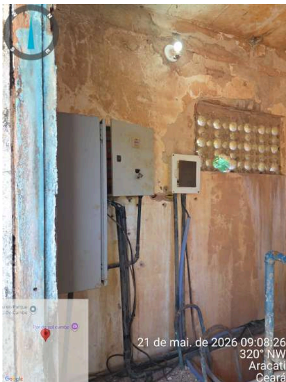
Foto 49 - Casa de comando PT-03 e PT-28 (sede): paredes desgastadas e fiação solta.
