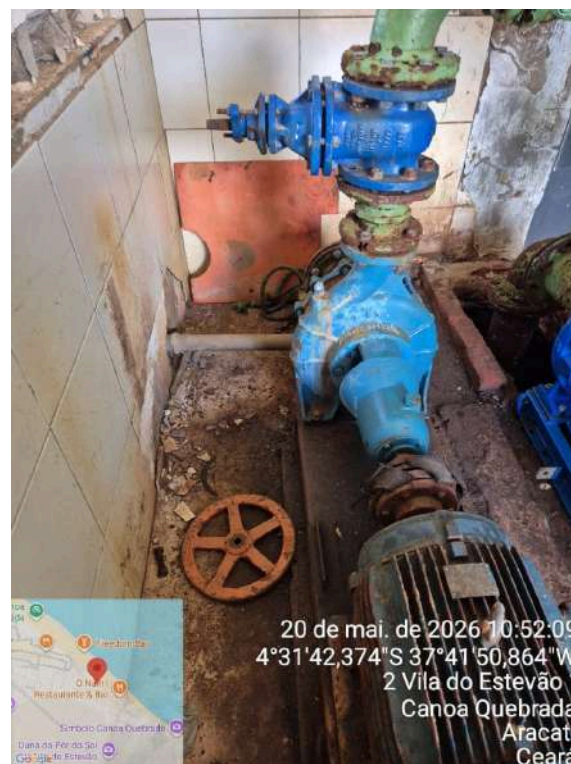
Foto 177 - EEAT-01 (Canoa): bomba sem caixa de proteção, área com sujidades.
