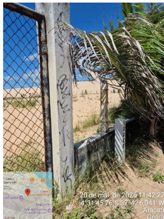
Foto 201 - REL-02 (Canoa): cerca quebrada.
