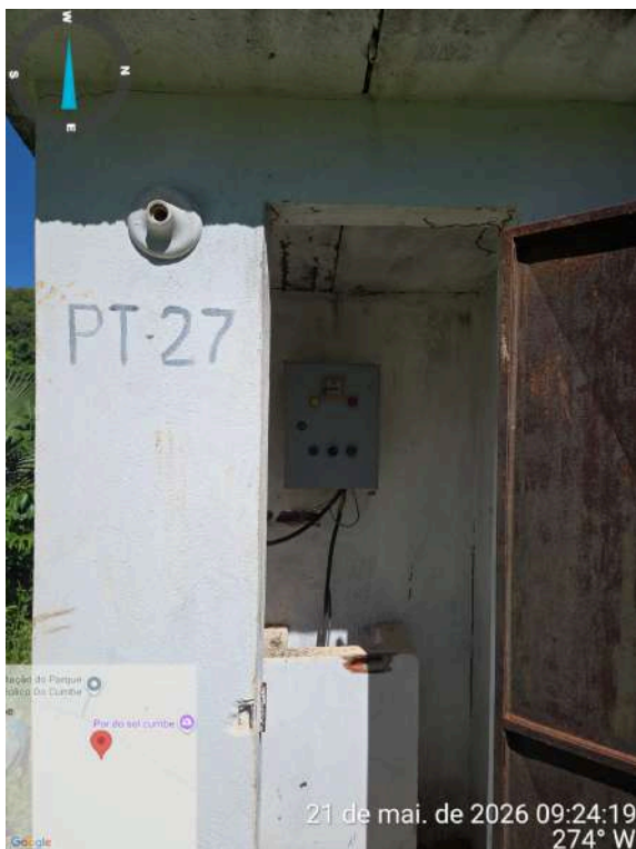
Foto 65 - PT-27 (sede): sem lâmpada, porta oxidada.
