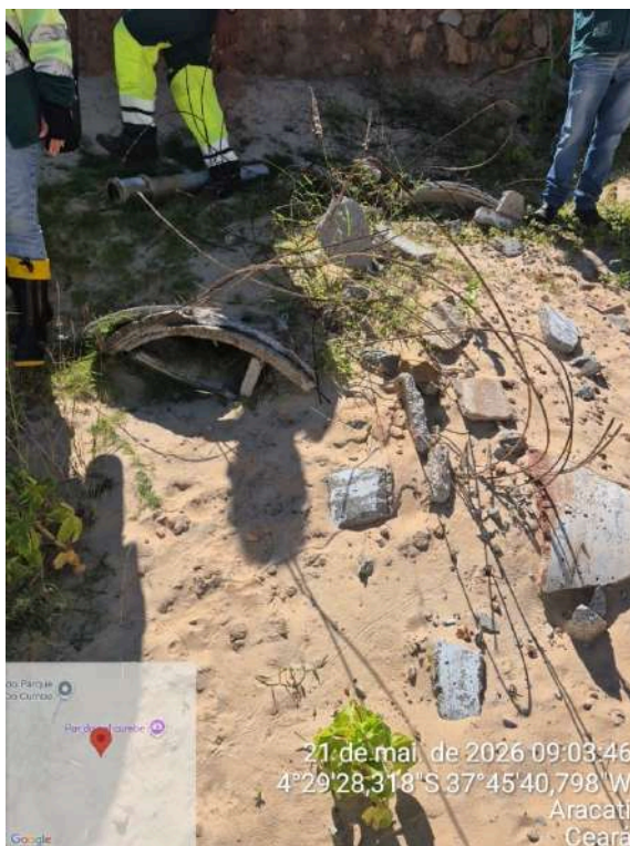
Foto 45 - PT-22 (sede): anéis de concreto e cerca quebrados, com risco operacional.
