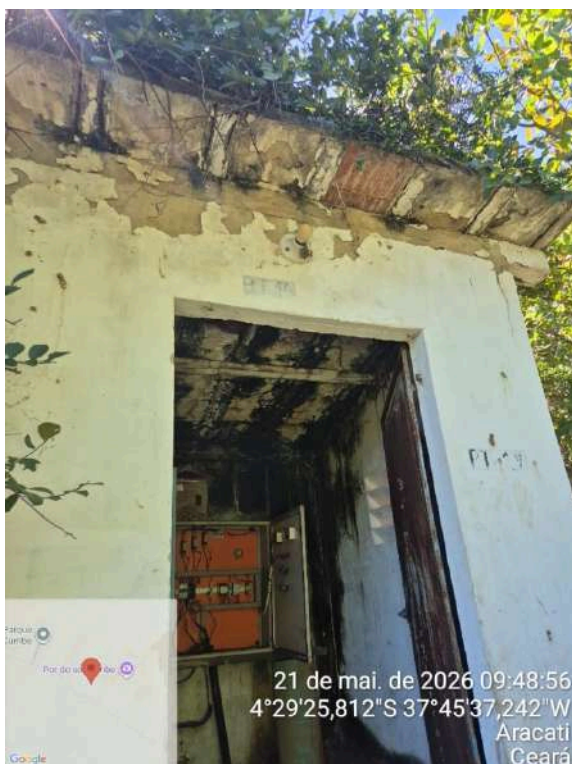
Foto 75 - PT-19 (sede): casa de comando com sinais de infiltração, porta oxidada, sem lâmpada, teto danificado.
