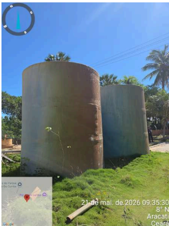
Foto 101 - ETA Cumbe (sede): equipamentos novos aguardando instalação com sinais de desgaste.
