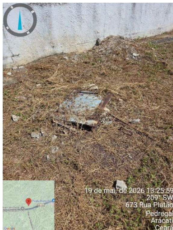
Foto 33 - RAP-04 (sede): tampa deslocada, com sujeira e apresentando risco de acidentes.
