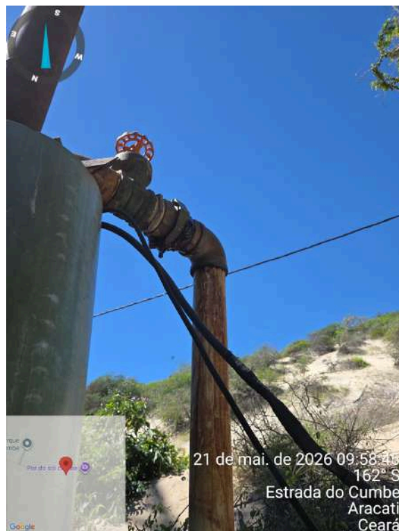
Foto 82 - PT-18 (sede): poço com vazamento e tubulação com oxidação.
