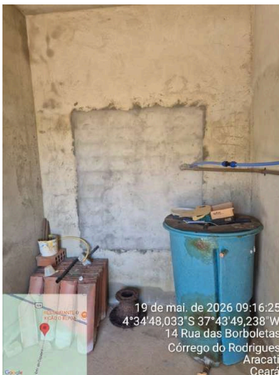
Foto 16 - EEAT-06 (sede): casa de cloração sem ventilação, com material guardado inadequado.
