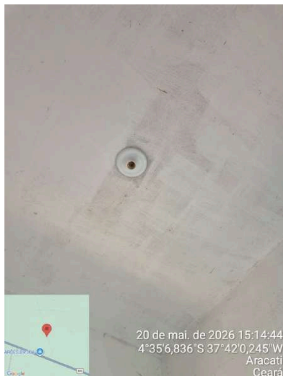
Foto 231 - PT-03 (Majorlândia): casa de comando sem lâmpada.
