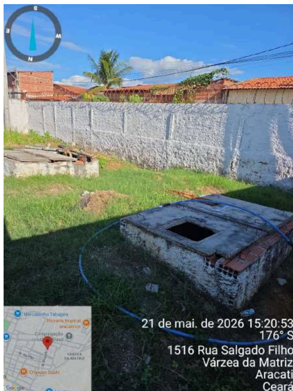
Foto 281 - EEE São Rafael (sede): tampa aberta.
