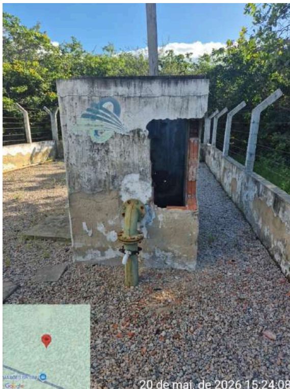
Foto 244 - PT-01 (Majorlândia): caixa do poço quebrada devido a dificuldade de acesso.
