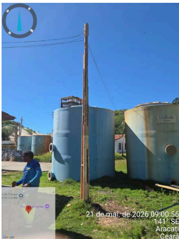
Foto 103 - ETA Cumbe (sede): poste com patologias estruturais, apresentando risco de queda.
