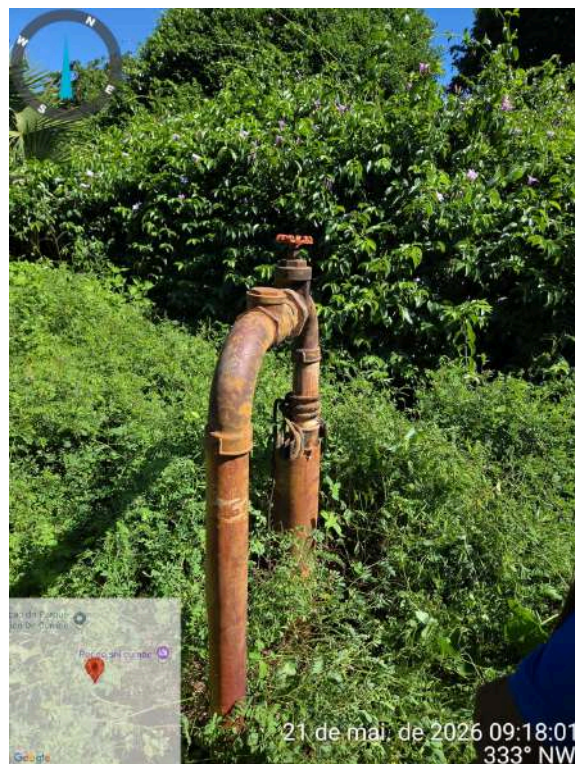
Foto 62 - PT-42 (sede): poço sem proteção e com tubulação oxidada.
