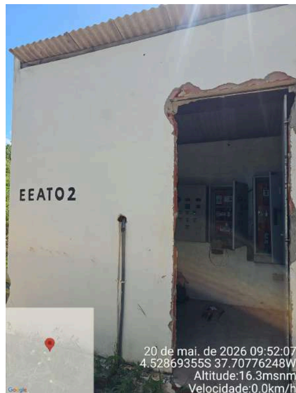
Foto 151 - EEAT-02 (Canoa): sem lâmpada e aviso de choque, umbral da porta danificado.
