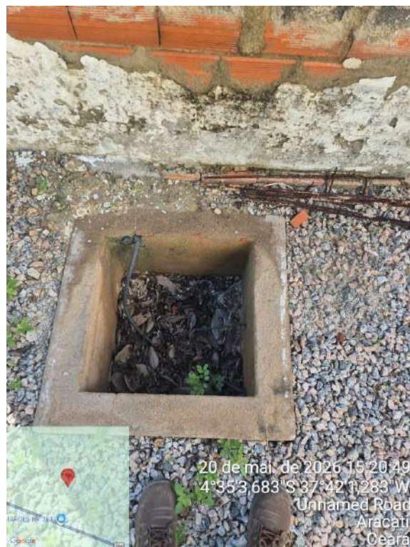
Foto 237 - PT-02 (Majorlândia): caixa sem tampa de proteção.
