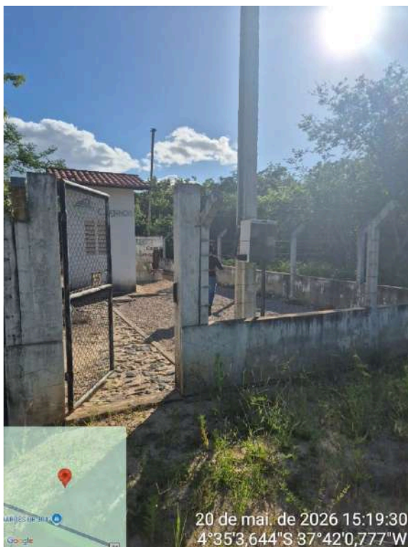
Foto 236 - PT-02 (Majorlândia): portão sem cadeado.
