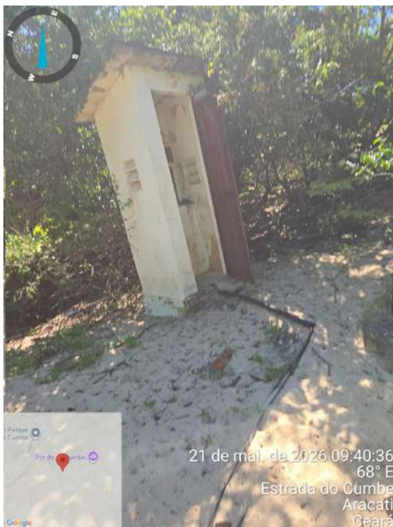
Foto 69 - PT-24 (sede): casa de comando com porta oxidada, teto oxidado, sem lâmpada e com fiação sem proteção.
