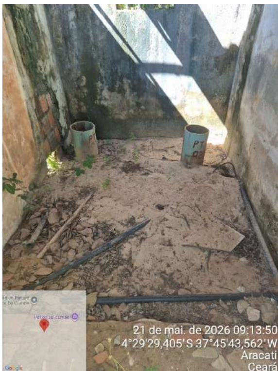
Foto 61 - PT-42 (sede): casa de comando com poços desativados com muita sujeira.
