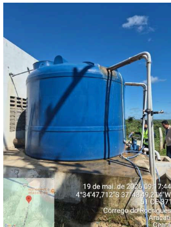
Foto 17 - RAP-06 (sede): vazamento na fibra.
