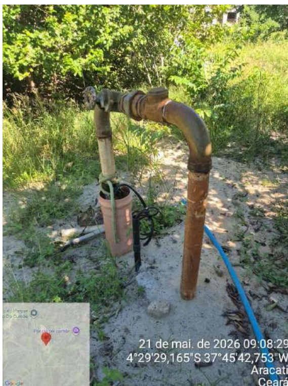
Foto 47 - PT-03 (sede): poço com tubulação oxidada.
