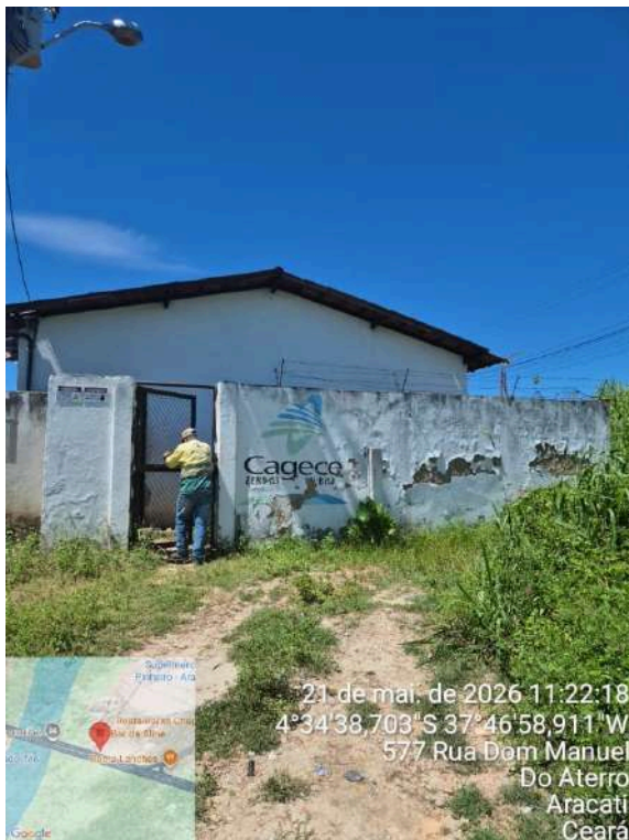
Foto 144 - Booster BR (sede): parede externa desgastada e com vegetação.
