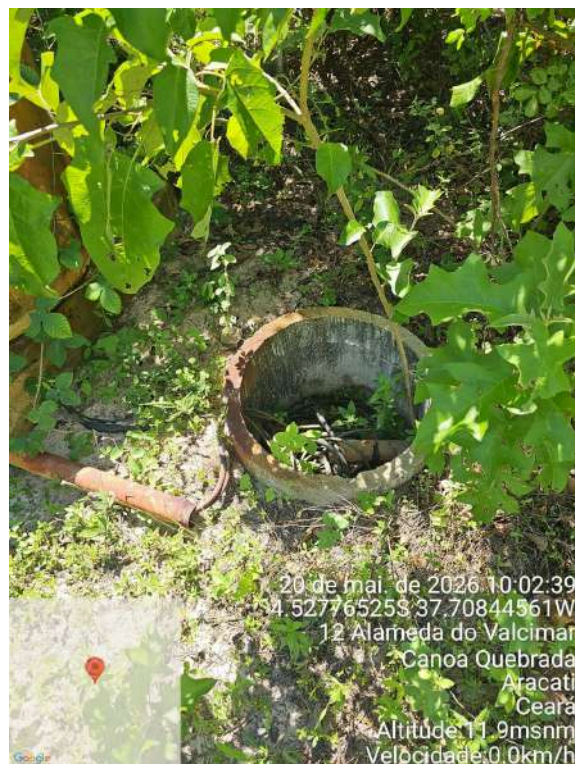
Foto 163 - PT-12 (Canoa): fiação exposta.
