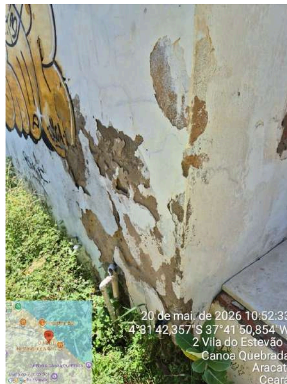
Foto 175 - EEAT-01 (Canoa): paredes desgastadas.
