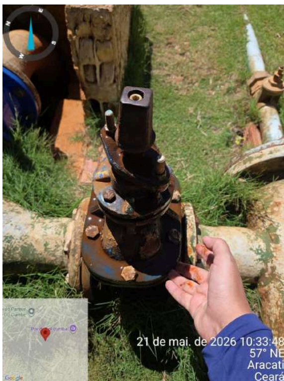
Foto 111 - ETA Cumbe (sede): F-01 com vazamento na válvula com oxidação elevada.
