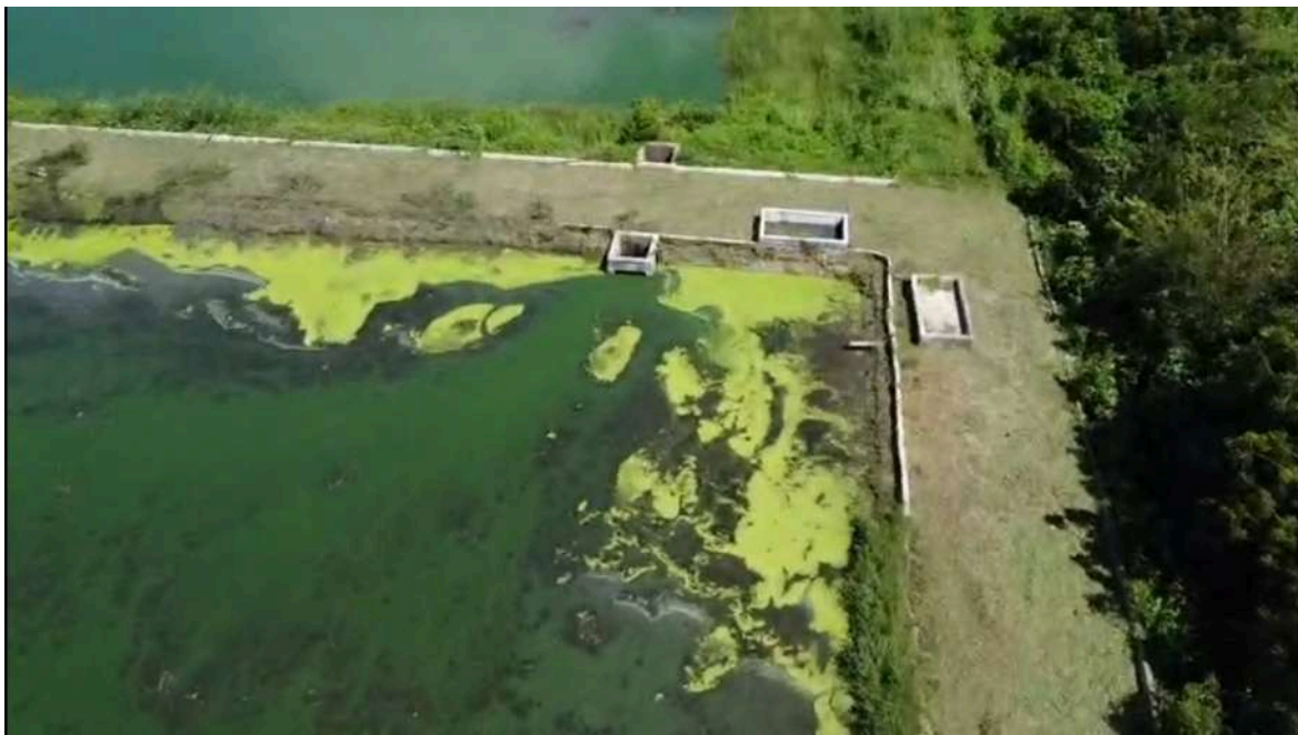
Foto 292 - ETE Canoa Quebrada : lagoa com vegetação e sujeira, reduzindo a área útil de tratamento.
