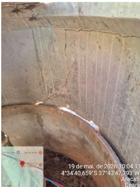
Foto 30 - PT-32 (sede): estrutura danificada.
