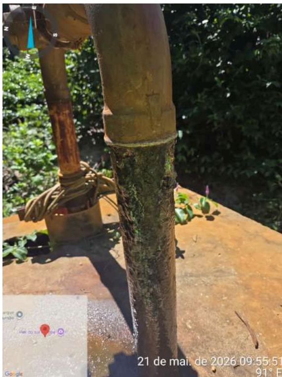
Foto 79 - PT-29 (sede): poço com caixa de proteção danificada, vazamento e alto teor de ferro.
