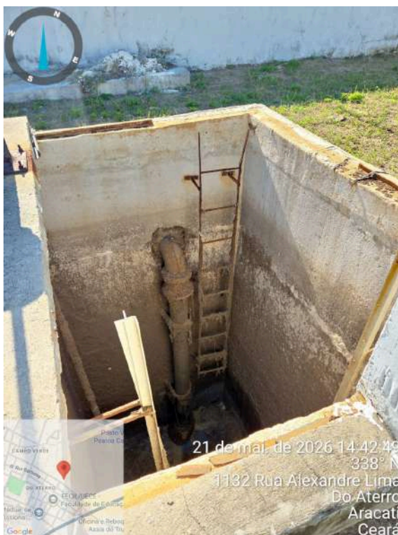
Foto 261 - ETE-A (sede): escada inutilizável, com sujeira e oxidação, guarda-corpo oxidado e quebrado.
