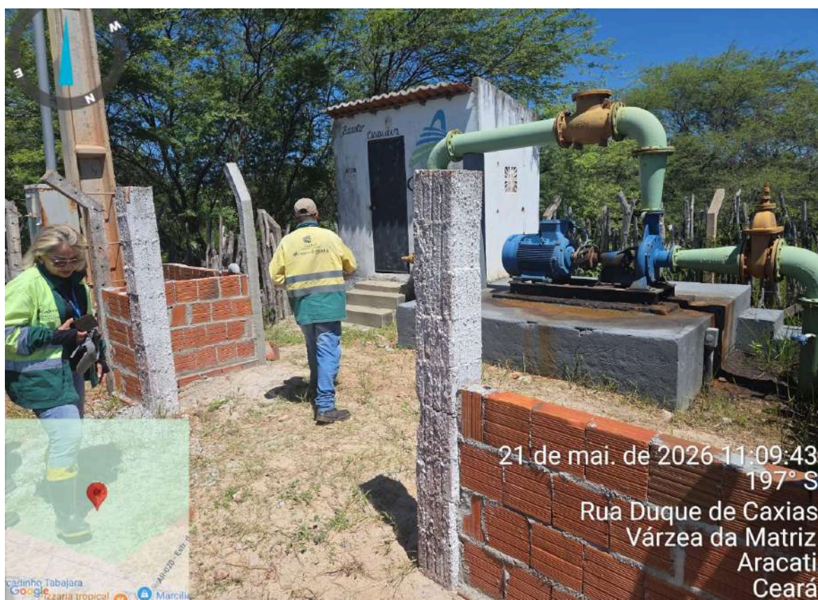
Foto 139 - Booster Canavieira (sede): sem fechamento.
