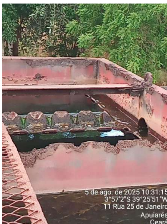
Foto 18 - Filtros: F-01 e F-02 apresentam processo corrosivo de sua infraestrutura.
