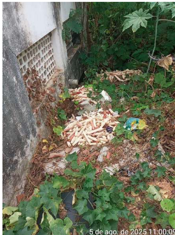
Foto 32 - Poço Amazonas (desativado): com acúmulo de lixo e entulhos ao seu redor.
