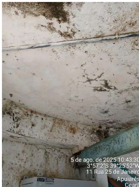
Foto 28 - Casa do Quadro de Comando (captação): infraestrutura com pintura deteriorada.
