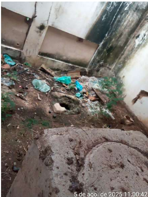
Foto 31 - Poço Amazonas (desativado): com acúmulo de lixo no interior.
