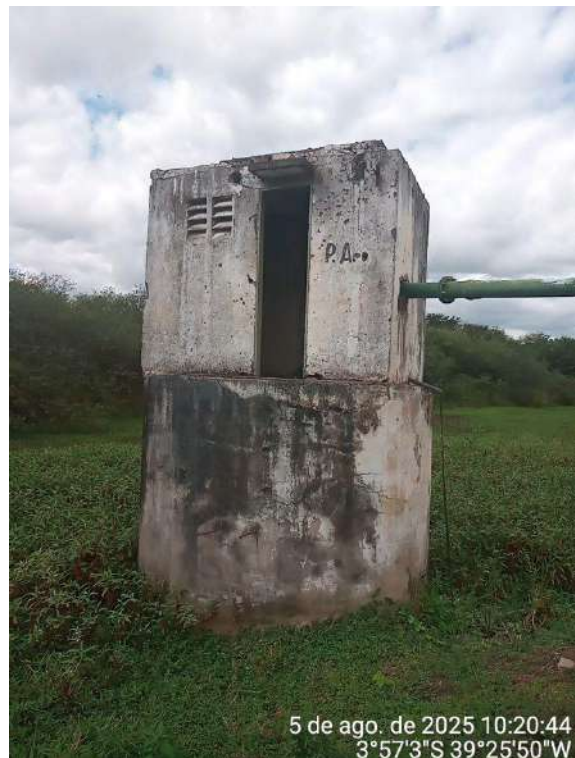
Foto 2 - Captação (Rio Curu): plataforma sem grade de proteção / guarda corpo e sem iluminação externa.
