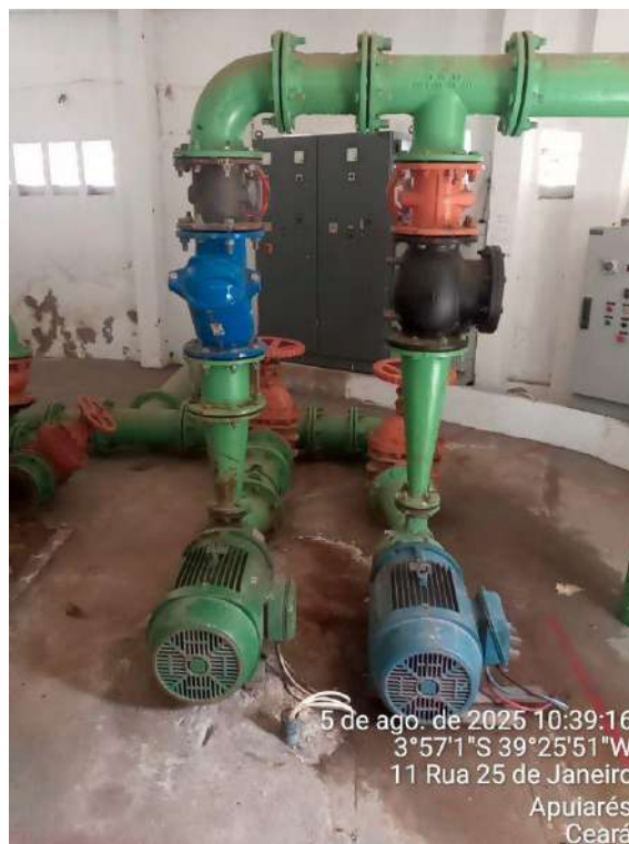
Foto 22 - EEAT-01: infraestrutura com revestimento e pintura deteriorados.
