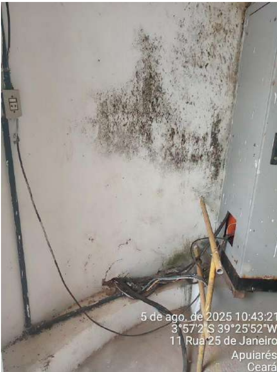
Foto 11 - Casa do Quadro de Comando (captação): pintura deteriorada e instalações elétricas precárias, sem eletroduto de isolamento e proteção.
