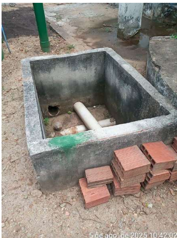
Foto 9 - ETA: caixa sem tampa.
