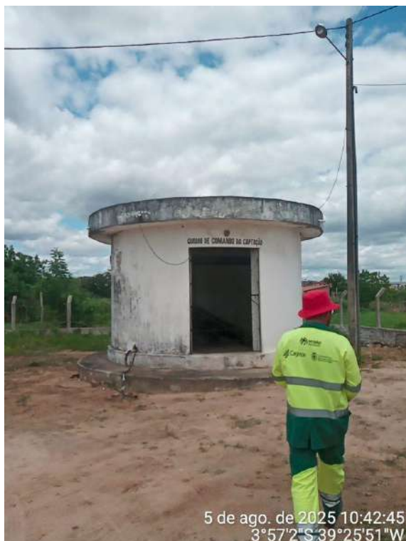
Foto 27 - Casa do Quadro de Comando (captação): infraestrutura com pintura deteriorada.
