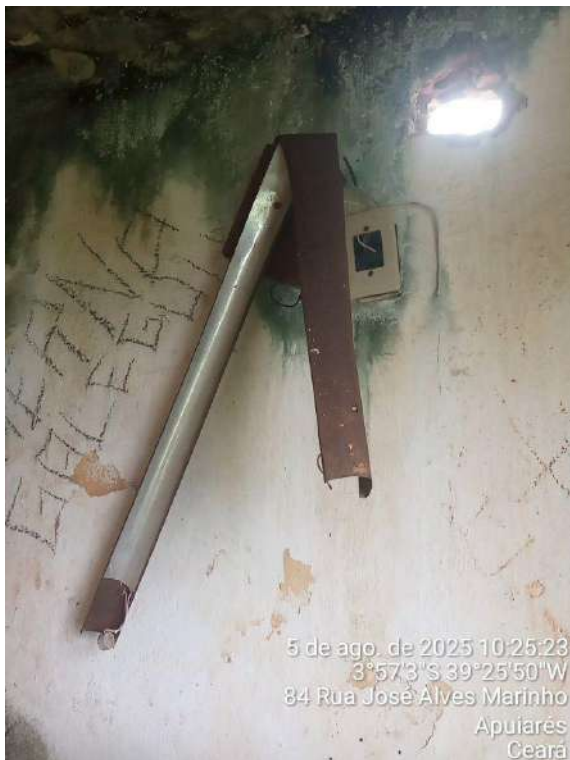
Foto 3 - Captação (Rio Curu): sem iluminação interna.
