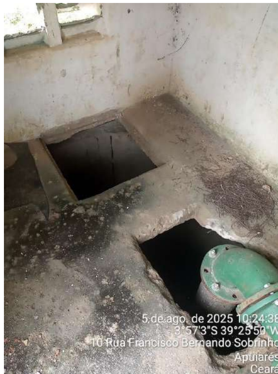
Foto 4 - Captação (Rio Curu): aberturas sem tampa de proteção.
