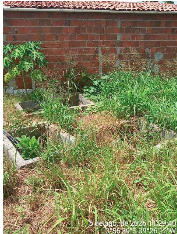
Foto 12 - REL-01: caixas de inspeção sem tampas.
