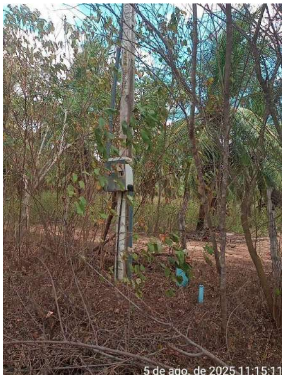
Foto 40 - Poços Tubulares (desativados): não há cerca de proteção contra o acesso.
