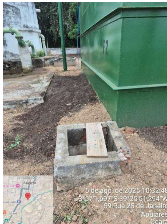
Foto 8 - ETA: caixa sem tampa.
