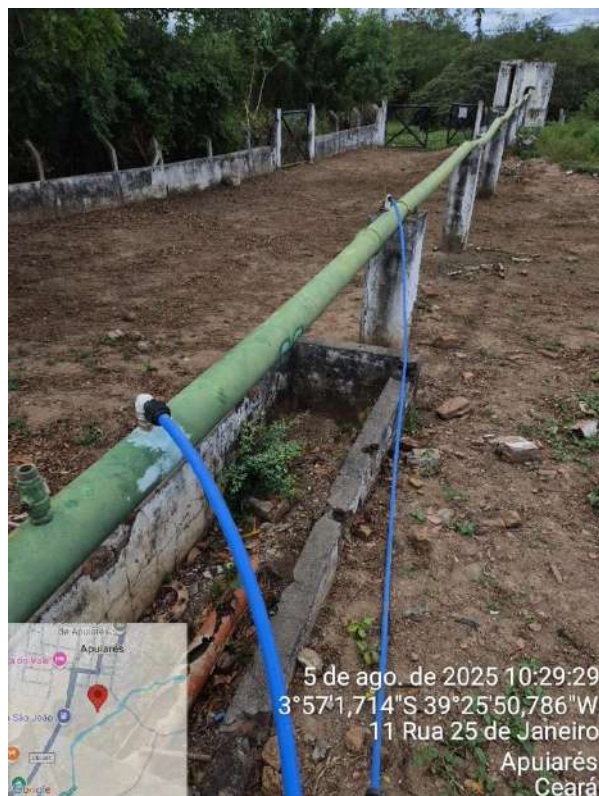
Foto 16 - Adutora: caixa em desuso não aterrada.
