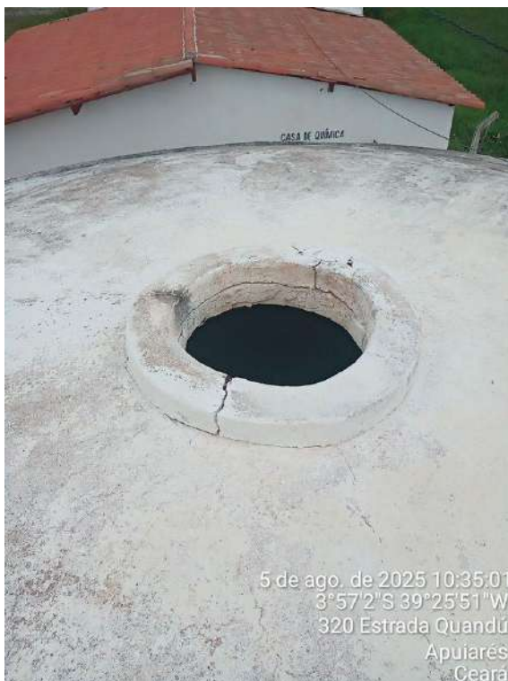
Foto 7 - RAP-02: abertura está sem tampa.
