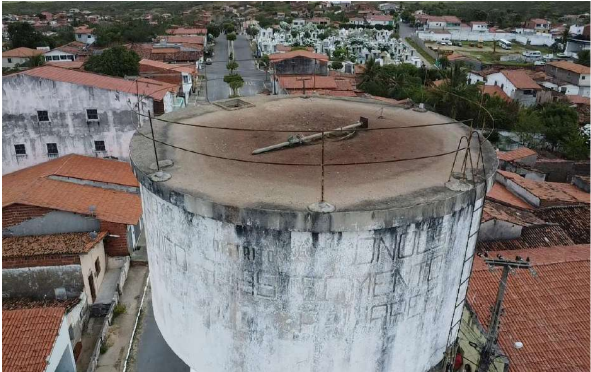
Foto 48 - REL-02 (desativado): infraestrutura fora de operação.
