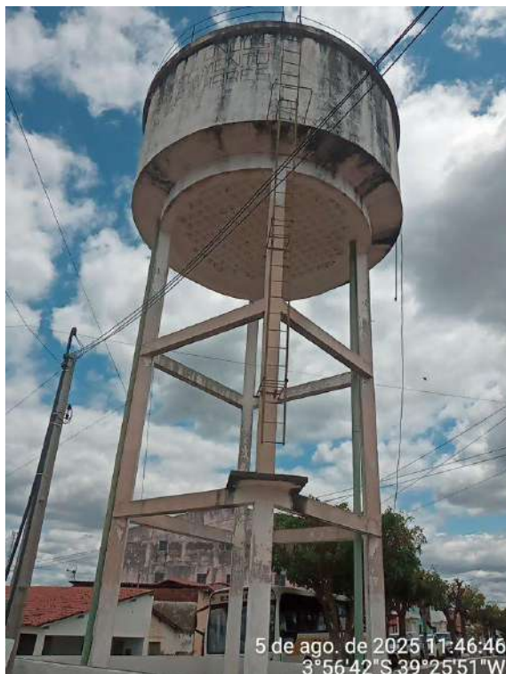
Foto 46 - REL-02 (desativado): infraestrutura fora de operação.
