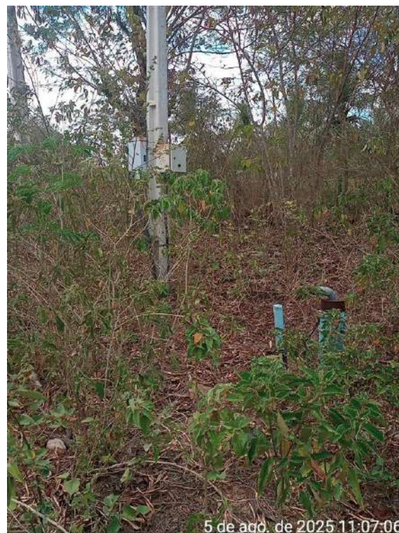
Foto 34 - Poços Tubulares (desativados): não há cerca de proteção contra o acesso.
