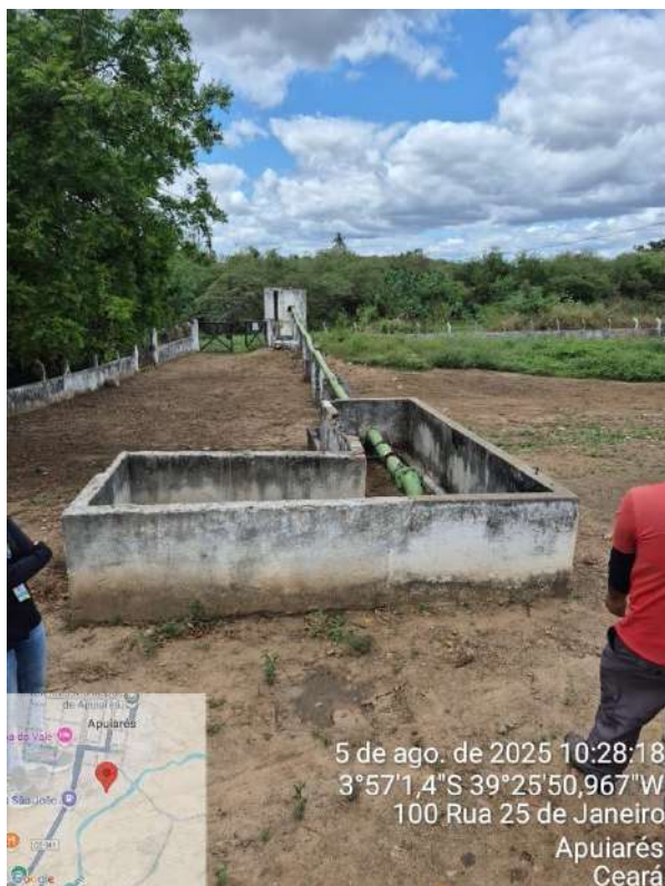
Foto 15 - Adutora: caixa de proteção de dispositivos com borda danificada e pintura degradada.
