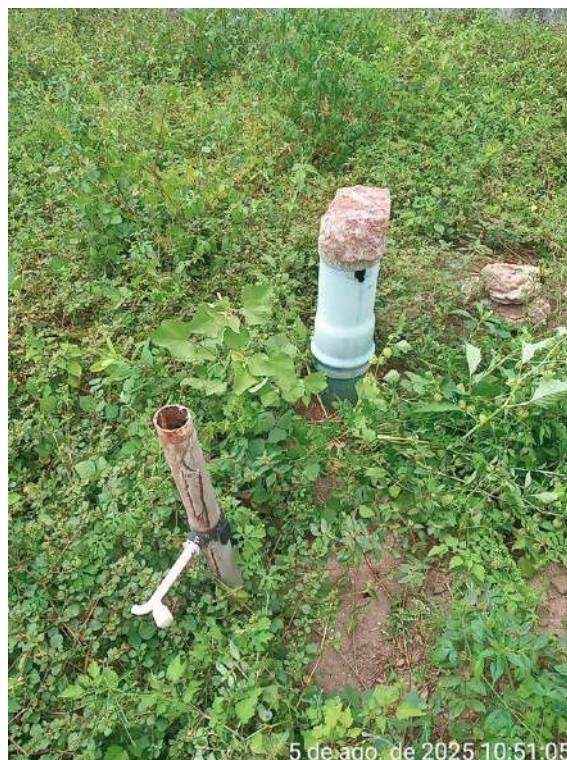
Foto 36 - Poços Tubulares (desativados): não há cerca de proteção contra o acesso. Foto 37
