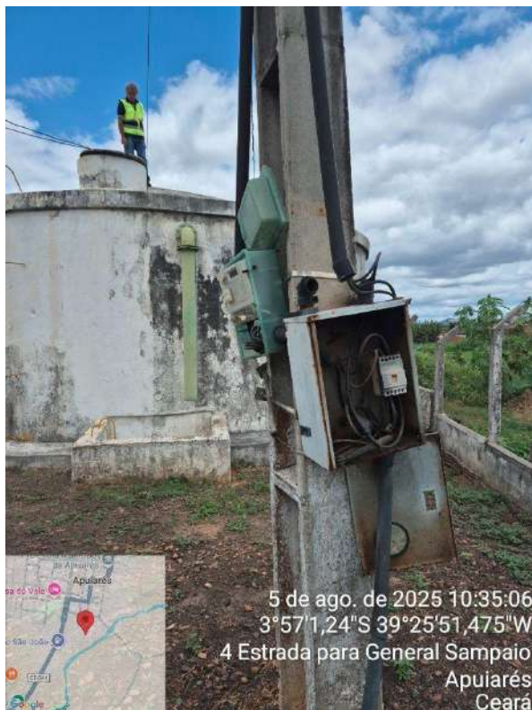
Foto 25 Quadros de energia: sem tampa e com corrosão.
