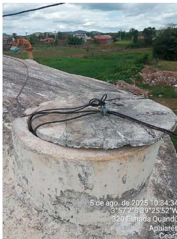
Foto 6 - RAP-02: instalações elétricas inadequadas, implantadas por sobre a laje e através da entrada de inspeção e sem eletroduto de isolamento e proteção.
