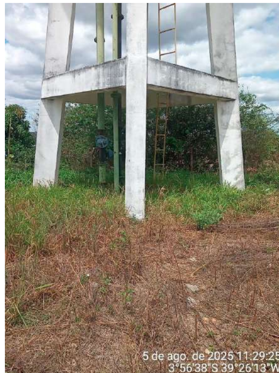
Foto 45 - REL-01: pintura deteriorada e vegetação crescida.
