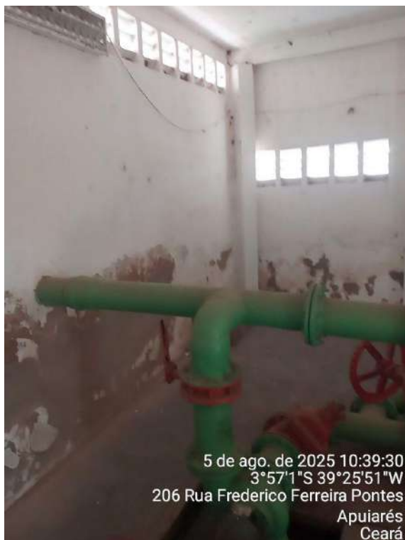
Foto 21 - EEAT-01: infraestrutura com revestimento e pintura deteriorados.
