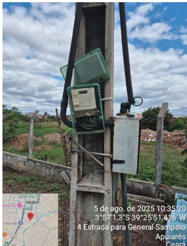
Foto 26 Quadros de energia: sem tampa e com corrosão.
