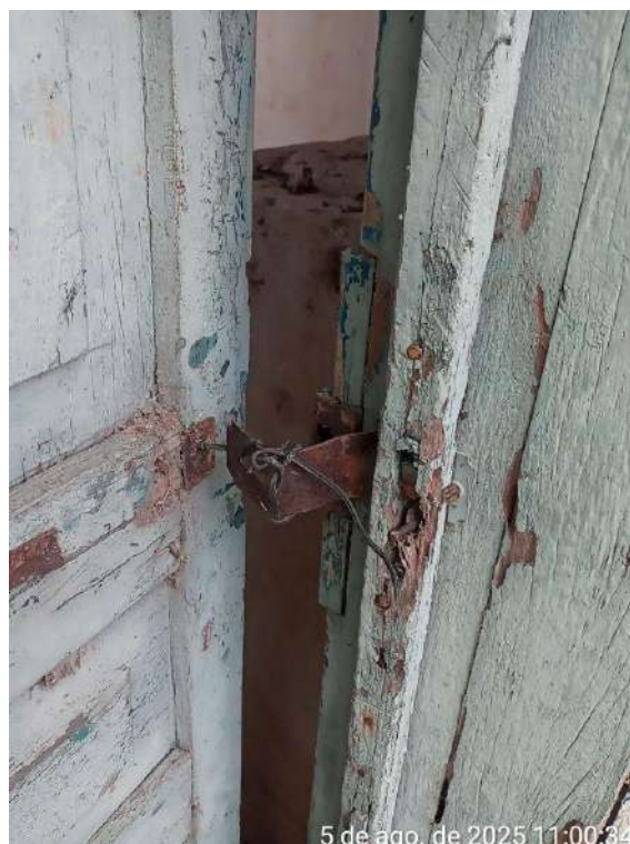
Foto 30 - Poço Amazonas (desativado): porta de acesso danificada, sem tranca.
