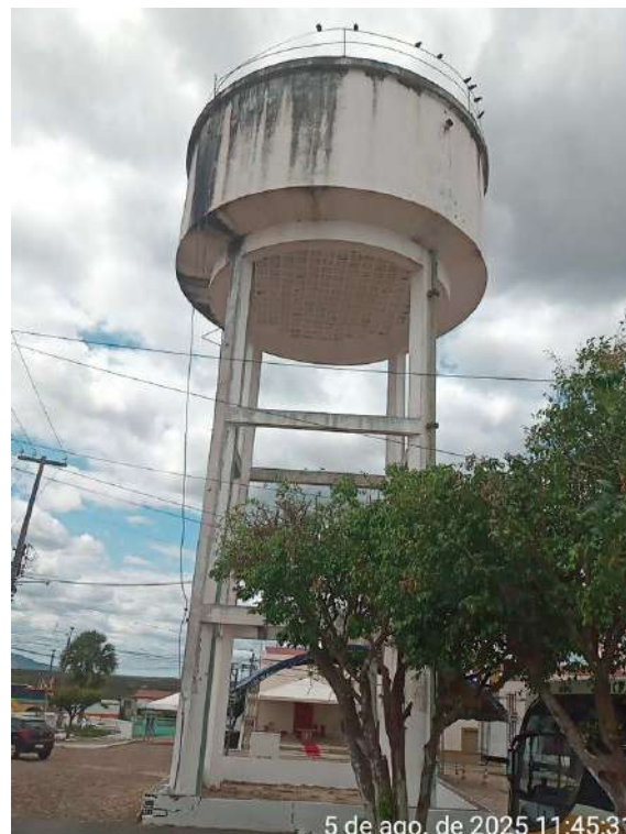
Foto 47 - REL-02 (desativado): infraestrutura fora de operação.
