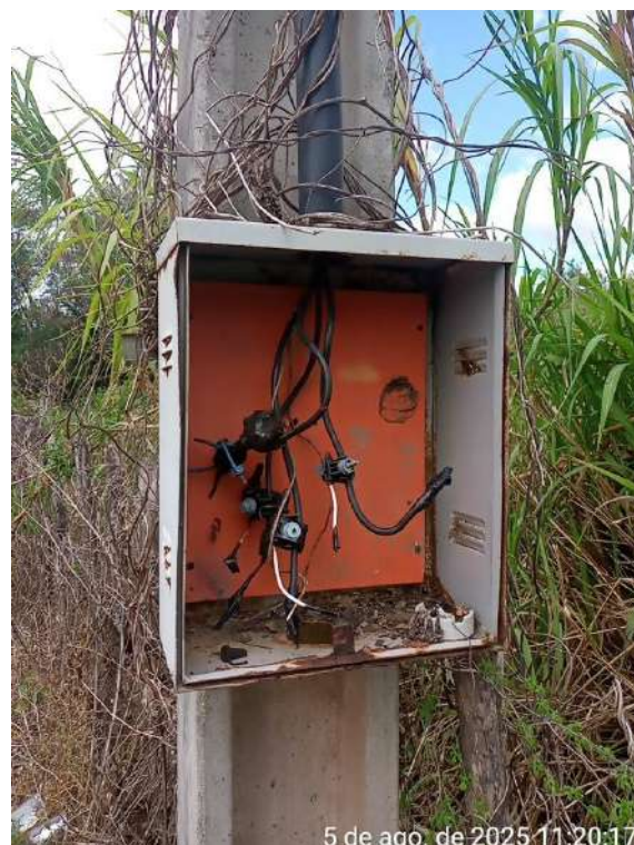
Foto 39 - Poços Tubulares (desativados): não há cerca de proteção contra o acesso.
