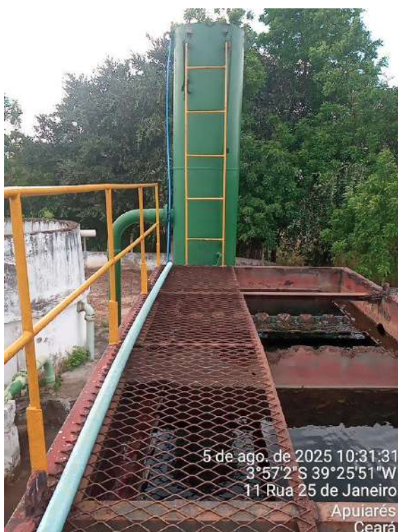
Foto 17 - Filtros: F-01 e F-02 apresentam processo corrosivo de sua infraestrutura.
