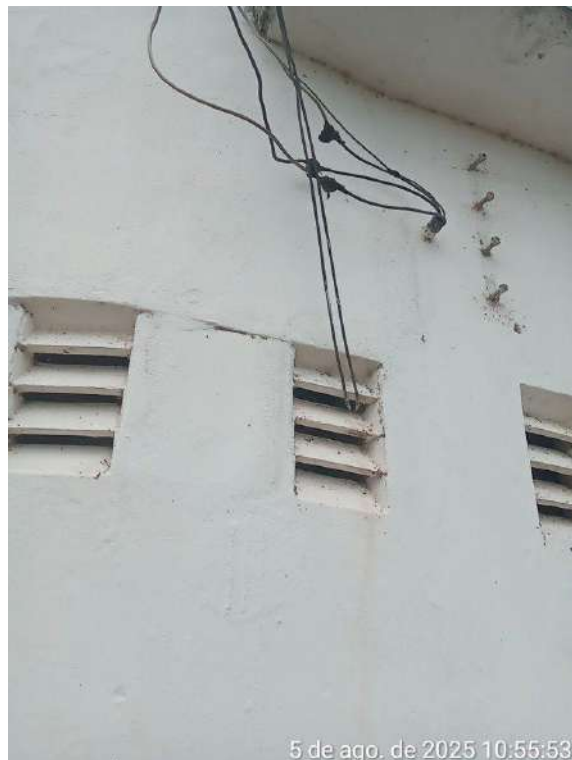
Foto 24 - EEAT-01: apresenta instalações elétricas sem eletrodutos de proteção e isolamento, e conduzidas através de cobogós.
