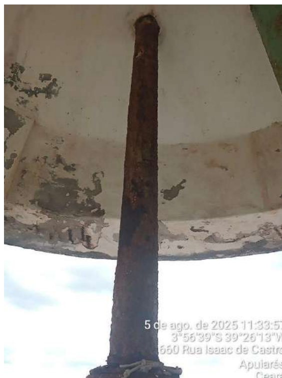
Foto 43 - REL-01: infraestrutura danificada com ferrugem exposta e tubulações em processo de corrosão.
