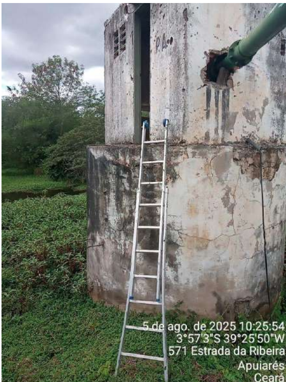
Foto 1 - Captação (Rio Curu): sem escada de acesso tipo marinheiro.
