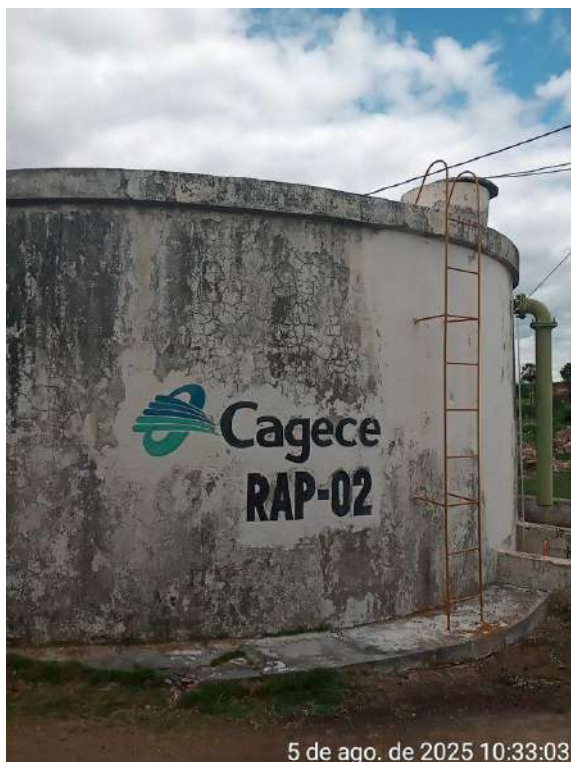
Foto 19 - RAP-02: infraestrutura com pintura deteriorada.
