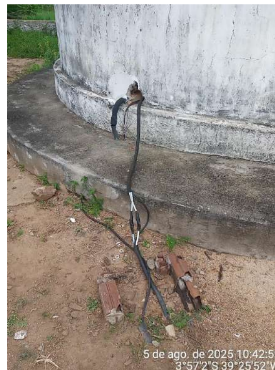
Foto 10 - Casa do Quadro de Comando (captação): pintura deteriorada e instalações elétricas precárias, sem eletroduto de isolamento e proteção.
