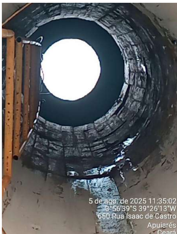
Foto 42 - REL-01: infraestrutura danificada com ferrugem exposta e vazamento.
