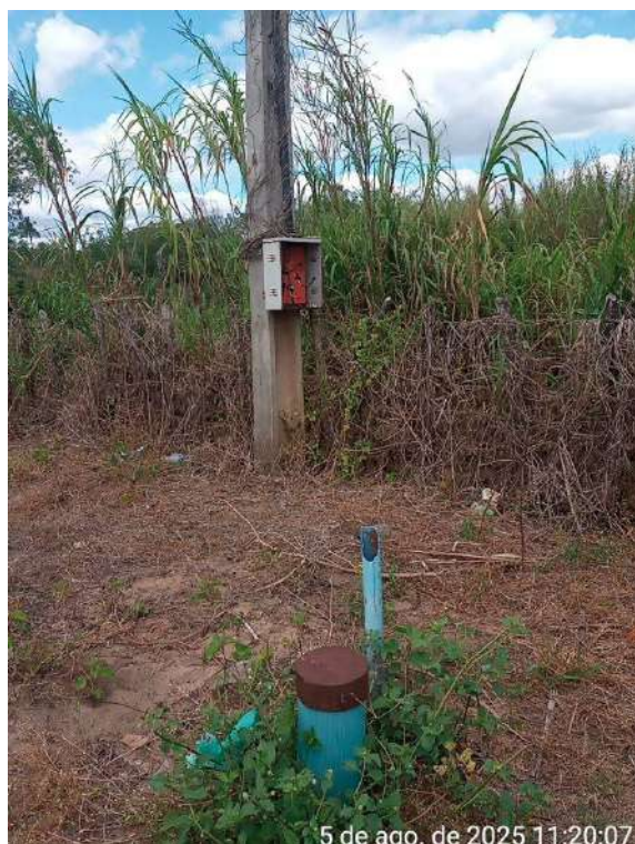
Foto 38 - Poços Tubulares (desativados): não há cerca de proteção contra o acesso.
