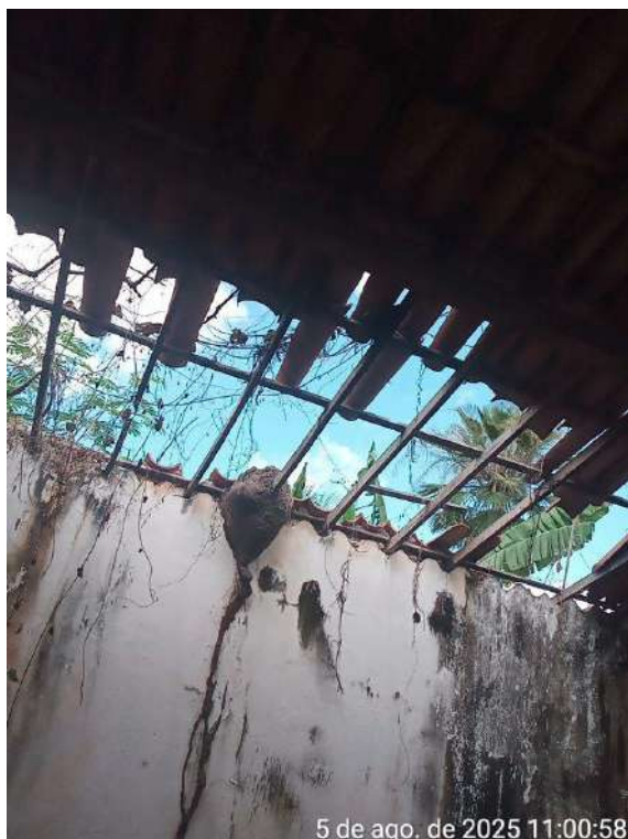
Foto 33 - Poço Amazonas (desativado): teto está desabando, denotando abandono total.
