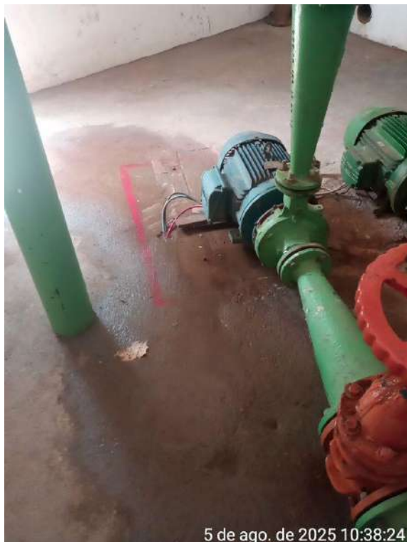
Foto 23 - EEAT-01: falha na drenagem, apresenta instalações elétricas sem eletrodutos de proteção e isolamento.
