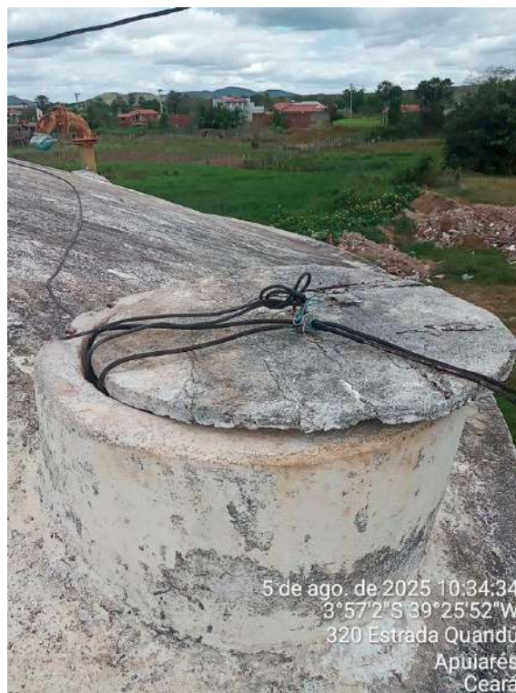
Foto 20 - RAP-02: tampa de inspeção danificada e sem fecho hermético.
