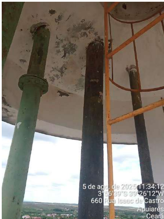
Foto 44 - REL-01: infraestrutura danificada e tubulações em processo de corrosão.
