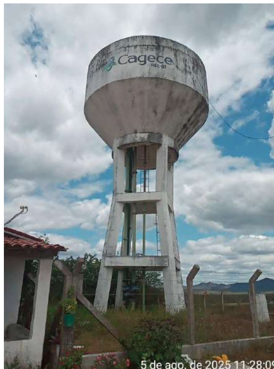
Foto 41 - REL-01: pintura deteriorada e vegetação crescida.
