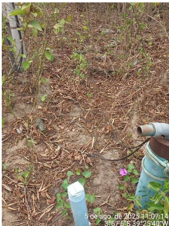
Foto 35 - Poços Tubulares (desativados): não há cerca de proteção contra o acesso.
