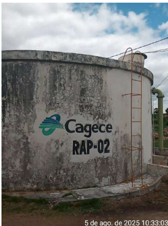
Foto 5 - RAP-02: escada de acesso tipo marinho inadequada (sem gaiola de proteção e grade de proteção / guarda corpo no patamar superior).
