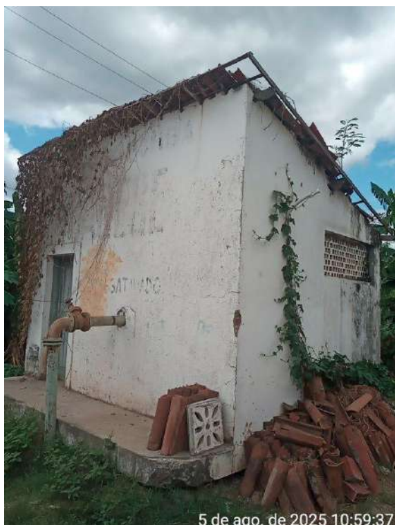
Foto 29 - Poço Amazonas (desativado): acúmulo de lixo e entulhos ao seu redor e planta trepadeira nas paredes e teto.
