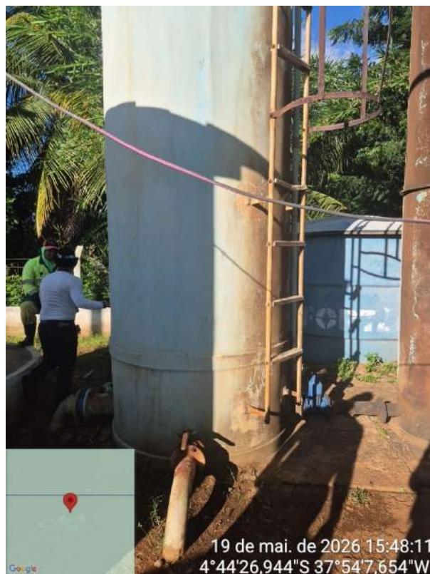
Foto 12 - ETA Tomé Afonso: fiação solta próximo ao filtro.
