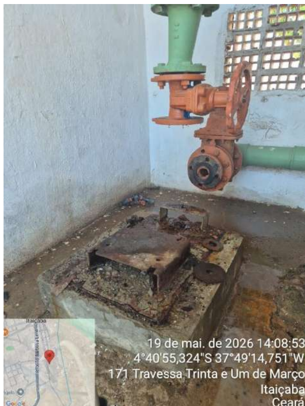
Foto 22 - EERD-01 (sede): base das bombas com oxidação avançada.
