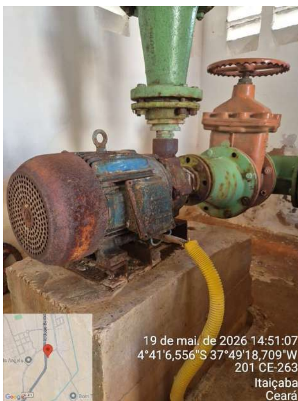
Foto 28 - ETA Itaiçaba / EEAT-01: bombas com oxidação avançada, junção faltando parafusos.
