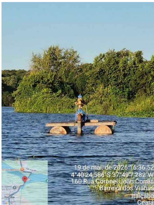
Foto 15 - Captação (sede): tubulação oxidada.
