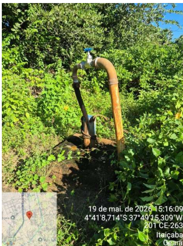
Foto 63 - PT-09 (sede): tubulação oxidada, poço sem proteção, coberto por vegetação.
