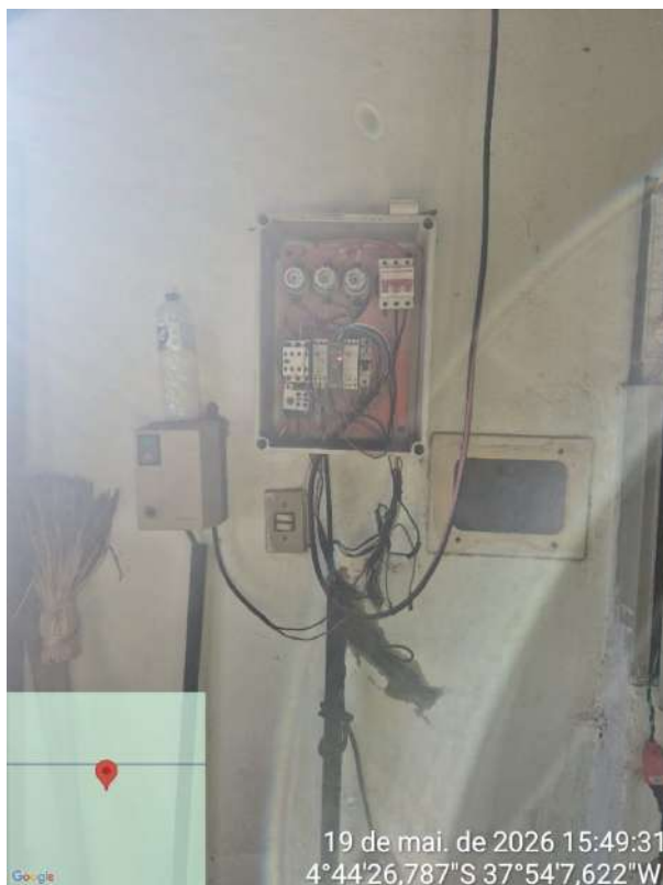
Foto 11 - ETA Tomé Afonso: pannel de comando sem tampa, fiação sem eletrodutos.
