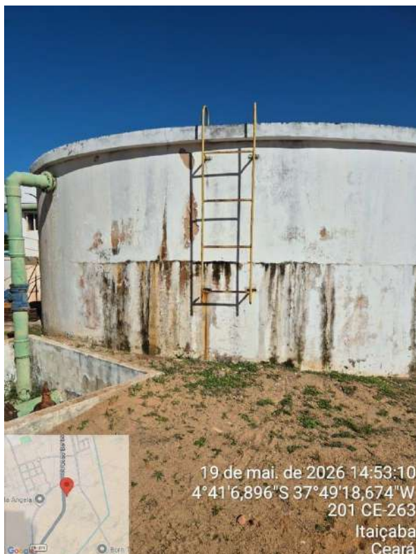
Foto 30 - ETA Itaíçaba / RSE-01: reservatório com rachaduras, vazamento e pintura deteriorada.
