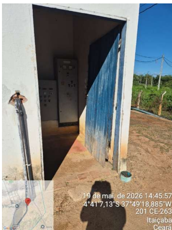
Foto 24 - ETA Itaíçaba / EERD-02: porta danificada, parede quebrada para passagem de tubulação.
