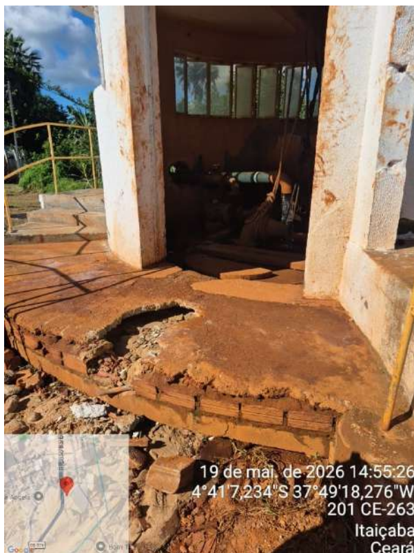
Foto 37 - ETA Itaíçaba / Poço de Reunião: desagregação acentuada do piso, com manchas de ferro.
