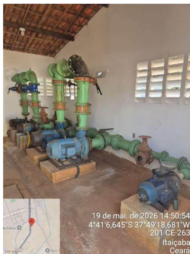
Foto 29 - ETA Itaiçaba / EEAT-01: bombas com oxidação avançada, piso desgastado.
