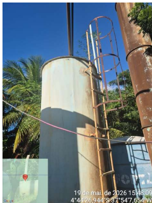
Foto 68 - ETA Tomé Afonso: escada oxidada e filtro com pintura desgastada.
