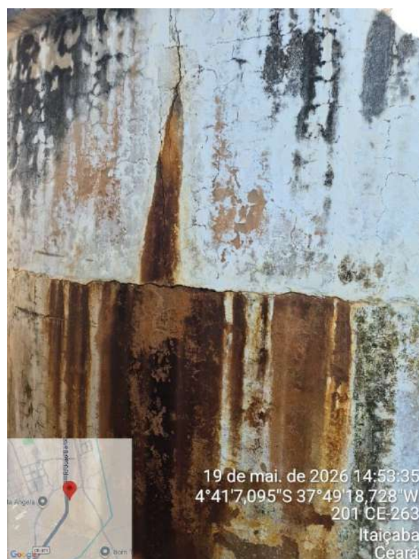
Foto 33 - ETA Itaíçaba / RSE-01: reservatório com rachaduras, vazamento e pintura deteriorada.
