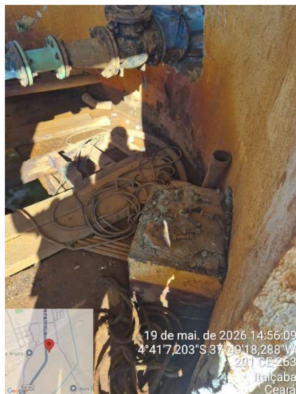
Foto 40 - ETA Itaíçaba / Poço de Reunião: cordas e parafusos sem armazenamento correto próximo
