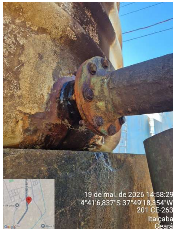
Foto 46 - ETA Itaíçaba: decantador com pintura deteriorada, vazamento e tubulação oxidada.
