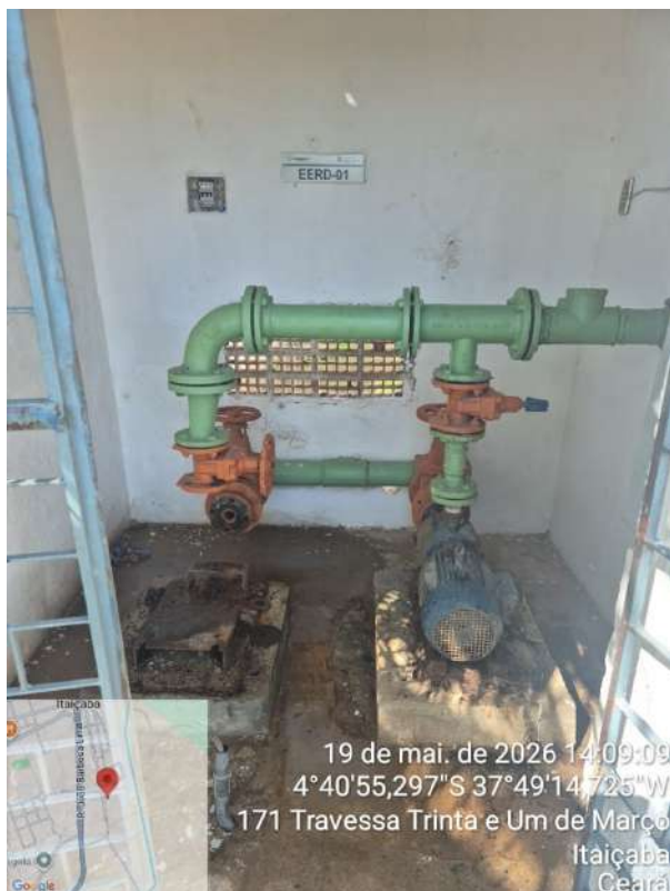
Foto 3 - EERD-01 (sede): sem bomba reserva.
