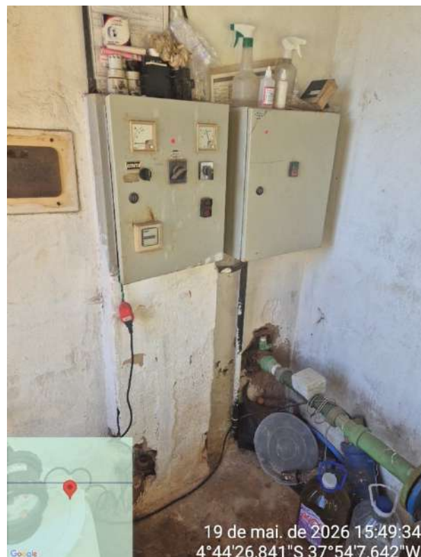
Foto 78 - ETA Tomé Afonso: parede desgastada, parcialmente quebrada, acúmulo de material de descarte inadequado.
