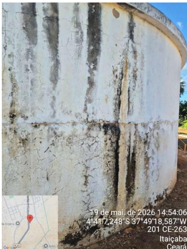
Foto 34 - ETA Itaipava / RSE-01: reservatório com rachaduras, vazamento e pintura deteriorada.
