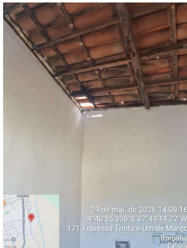
Foto 23 - EERD-01 (sede): telhado quebrado.
