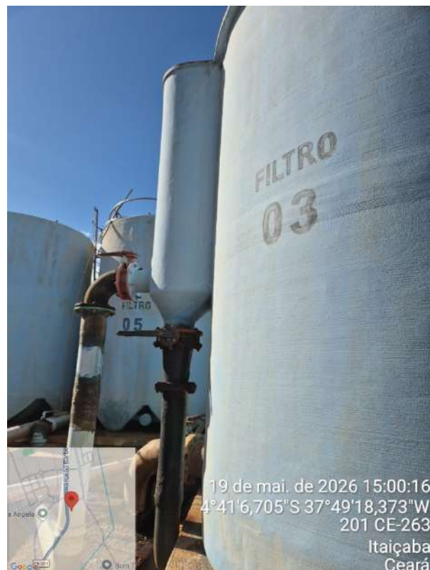
Foto 50 - ETA Itaiçaba: F-03 com tubulação desgastada.
