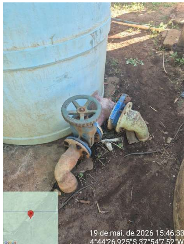
Foto 70 - ETA Tomé Afonso: filtro com tubulação desgastada.
