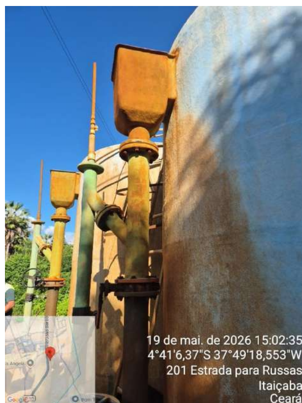
Foto 52 - ETA Itaiçaba: F-04 com pintura desgastada e tubulações oxidadas.
