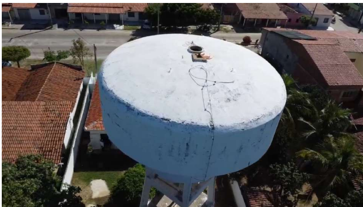
Foto 17 - REL-01 (sede): pintura desgastada, tampa deslocada, laje com rachaduras.
