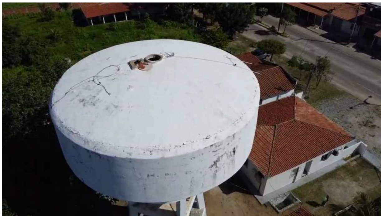
Foto 1 - REL-01 ( sede ): sem escada de acesso a parte superior, laje sem guarda-corpo e para-raio.
