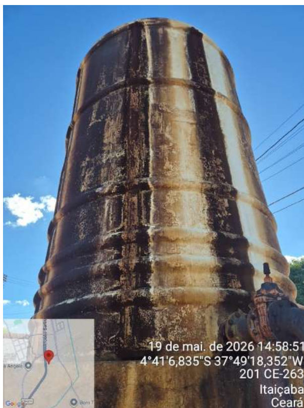
Foto 47 - ETA Itaíçaba: decantador com pintura deteriorada, vazamento e tubulação oxidada.
