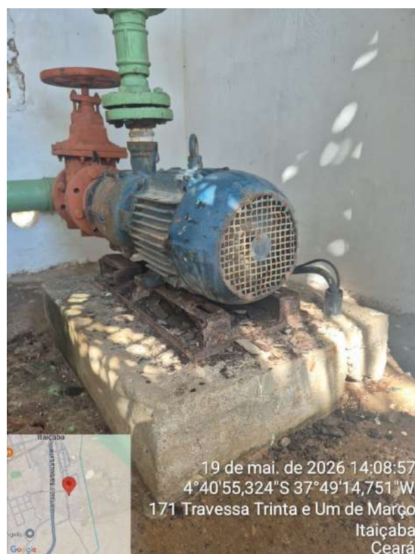
Foto 21 - EERD-01 (sede): base das bombas com oxidação avançada.
