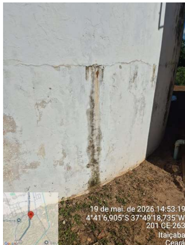
Foto 31 - ETA Itaíçaba / RSE-01: reservatório com rachaduras, vazamento e pintura deteriorada.
