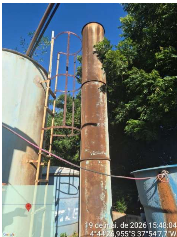
Foto 67 - ETA Tomé Afonso: torre de equilíbrio com pintura desgastada.
