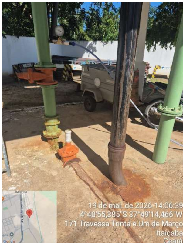
Foto 18 - REL-01 (sede): tubulação oxidada.
