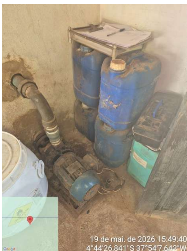
Foto 79 - ETA Tomé Afonso: bomba e base oxidadas, parede desgastada.
