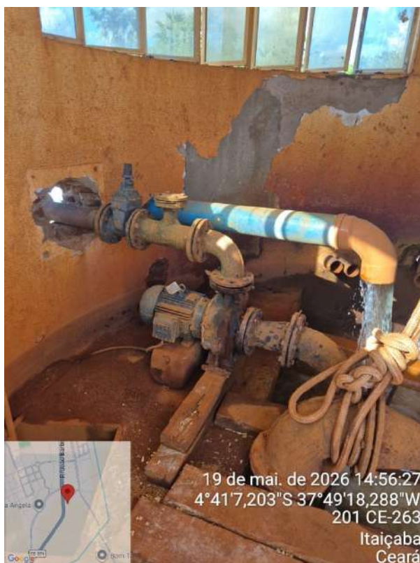
Foto 39 - ETA Itaíçaba / Poço de Reunião: tubulações oxidadas e parede desgastada, com
