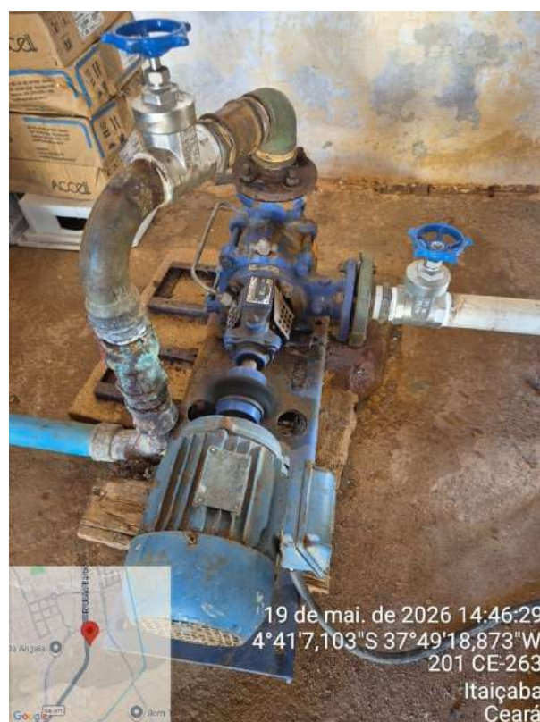
Foto 25 - ETA Itaíçaba / EERD-02: bomba sem proteção e com vazamento, tubulações e base oxidadas.
