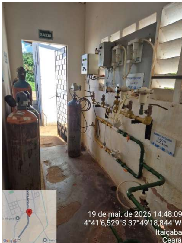
Foto 26 - ETA Itaiçaba / Cloro: piso e parede com desgaste.
