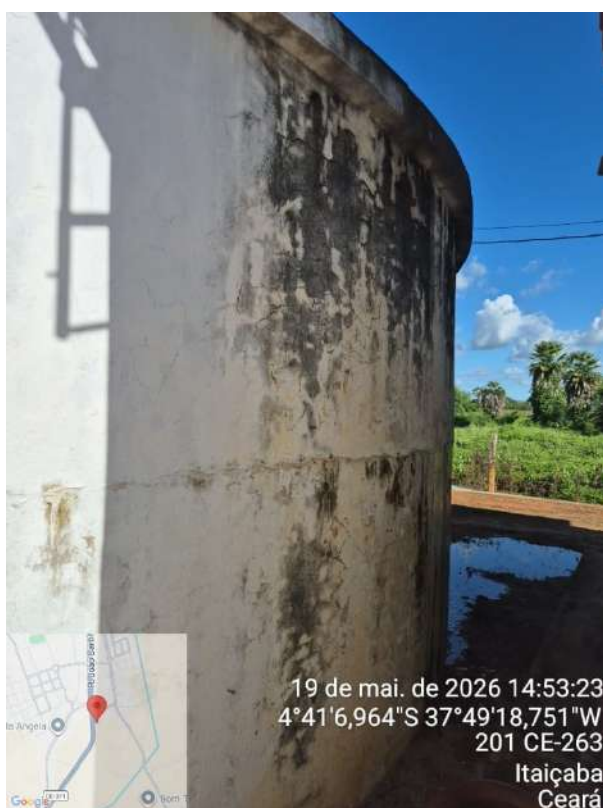
Foto 32 - ETA Itaíçaba / RSE-01: reservatório com rachaduras, vazamento e pintura deteriorada.
