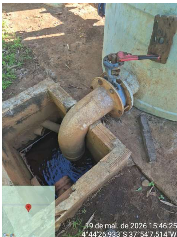
Foto 13 - ETA Tomé Afonso: caixa sem grade de proteção.
