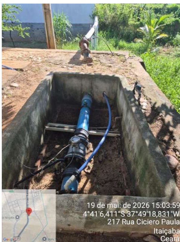
Foto 9 - ETA Itaíçaba: tubulação de saída do reservatório sem grade/tampa.
