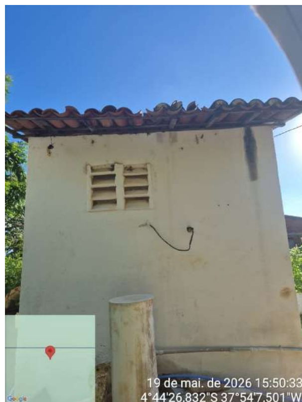
Foto 76 - ETA Tomé Afonso: casa com parede desgastada e telhado quebrado.
