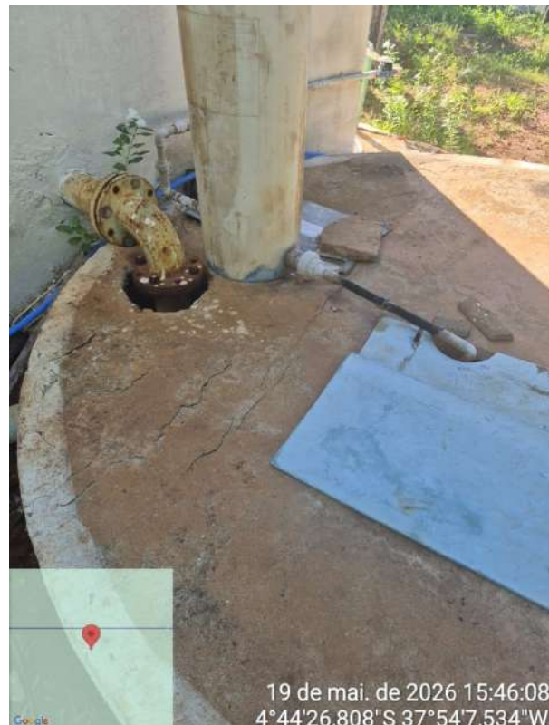
Foto 74 - ETA Tomé Afonso: REN-01 com fissuras, tubulação sem todos os parafusos oxidada, tampa e apoio improvisados.
