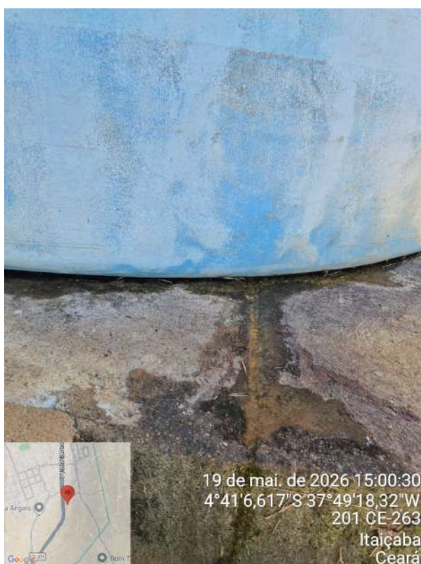
Foto 51 - ETA Itaiçaba: F-03 com vazamento na parte inferior.
