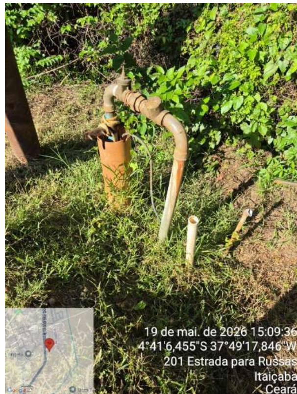
Foto 66 - PT-12 (sede): tubulação oxidada, poço sem proteção, coberto por vegetação.
