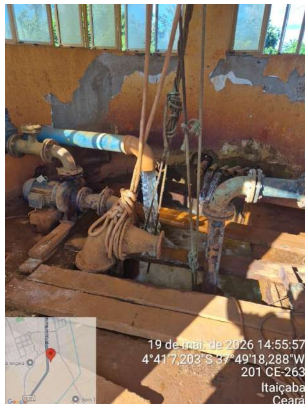
Foto 38 - ETA Itaíçaba / Poço de Reunião: tubulações oxidadas e parede desgastada.
