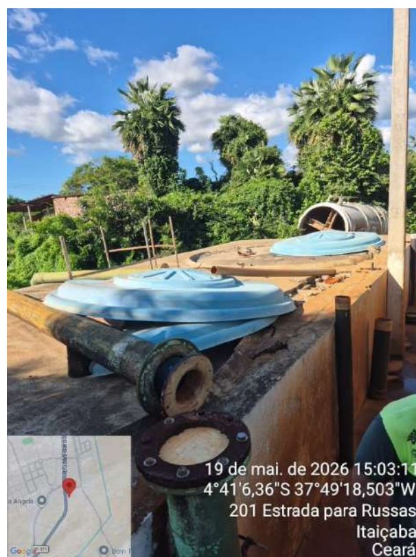
Foto 56 - ETA Itaíçaba: base antiga do decantador erodiu, acumulando material inadequadamente.
