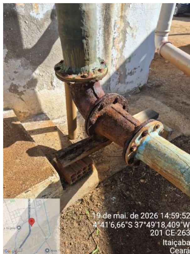
Foto 48 - ETA Itaíçaba: decantador com tubulação oxidada e apoio improvisado.
