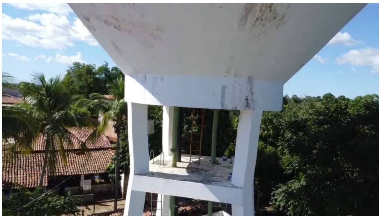
Foto 2 - REL-01 ( sede ): plataforma sem guarda-corpo.
