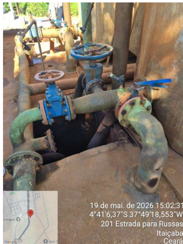
Foto 8 - ETA Itaíçaba: F-04 com tubulações oxidadas, abertura sem grade de proteção.
