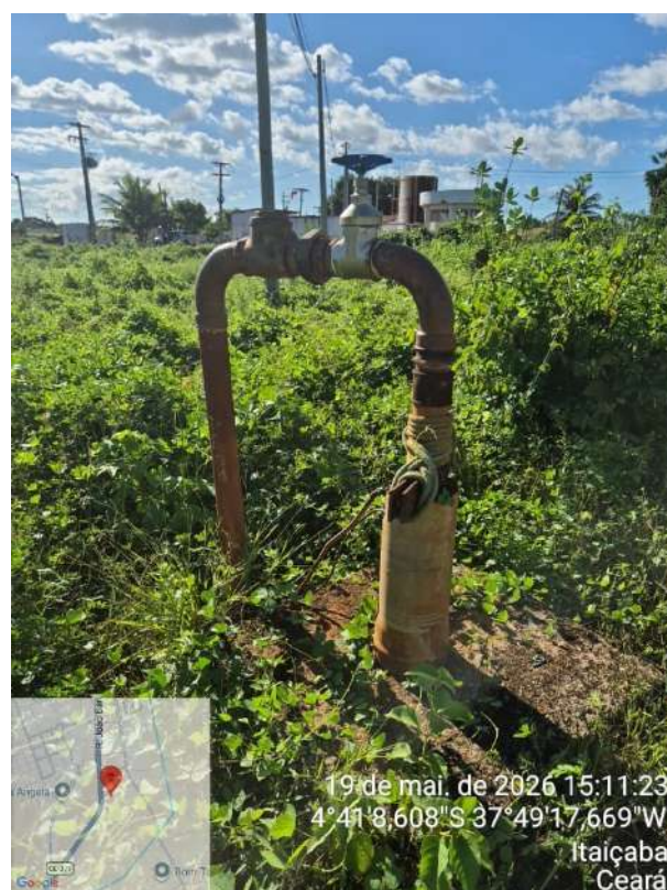
Foto 60 - PT-04 (sede): tubulação oxidada, poço sem proteção.
