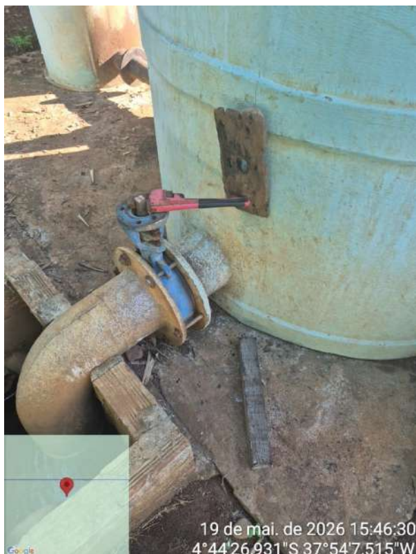
Foto 69 - ETA Tomé Afonso: filtro com chave presa na válvula com apoio improvisado.
