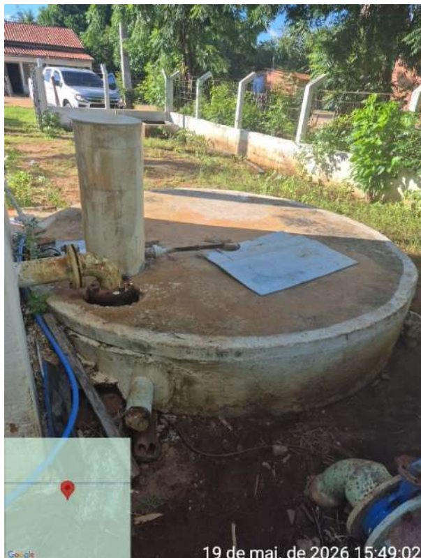
Foto 73 - ETA Tomé Afonso: REN-01 com abertura da tubulação inadequada, pintura desgastada.
