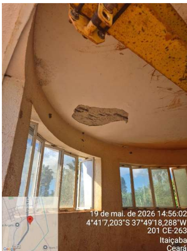
Foto 5 - ETA Itaiciaba / Poço de Reunião: teto com armadura exposta.
