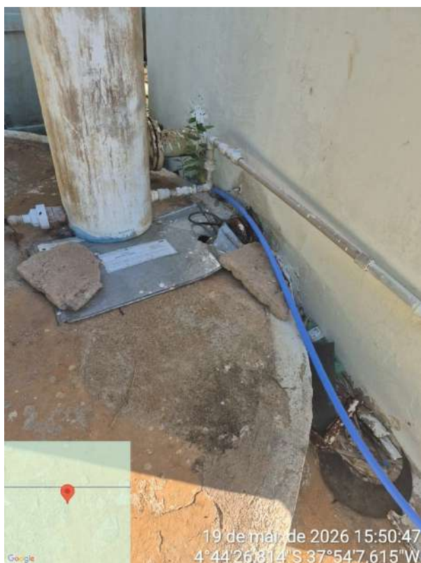
Foto 75 - ETA Tomé Afonso: REN-01 com tampa e apoio improvisados.
