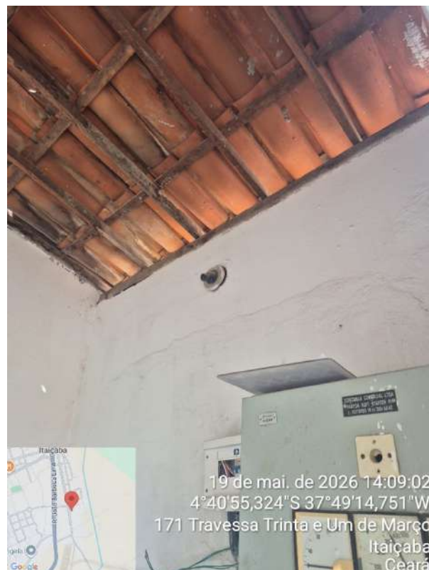
Foto 4 - EERD-01 (sede): sem iluminação.
