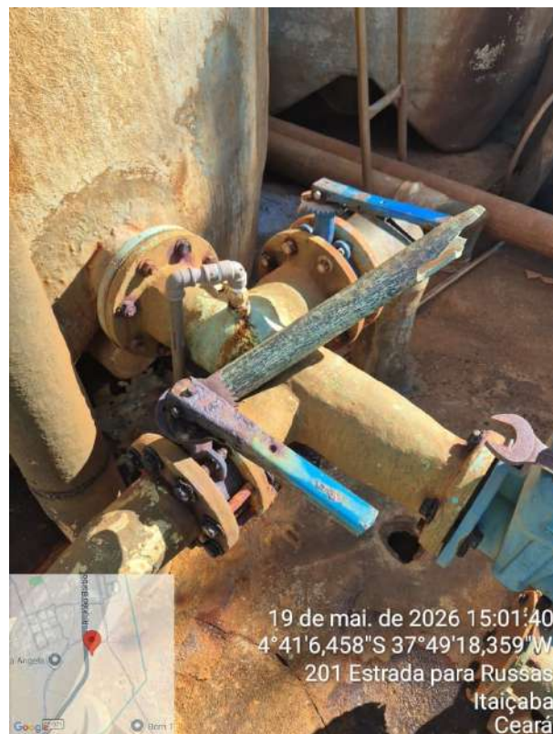
Foto 54 - ETA Itaíçaba: F-05 com parafusos oxidados e registro improvisado.
