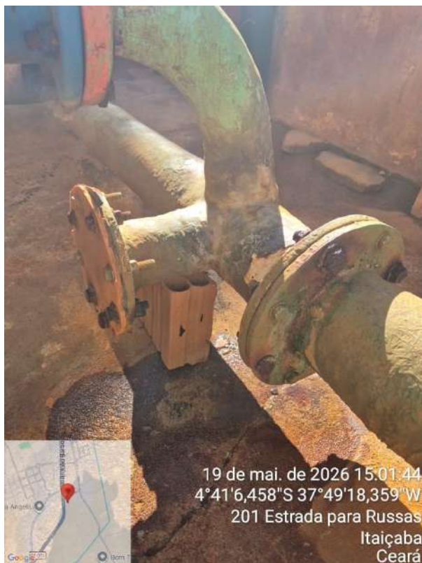
Foto 53 - ETA Itaíçaba: F-05 com tubulação desgastada e apoio improvisado.
