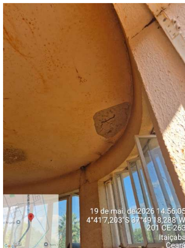
Foto 6 - ETA Itaiciaba / Poço de Reunião: teto com armadura exposta.
