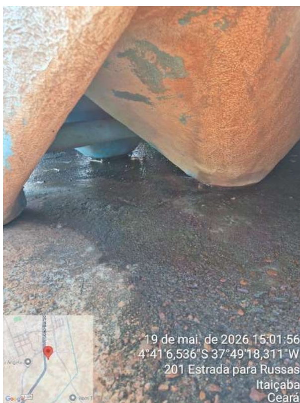
Foto 55 - ETA Itaíçaba: F-05 com indícios de vazamento.
