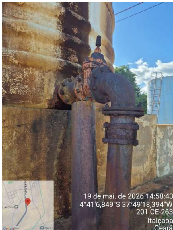
Foto 49 - ETA Itaiçaba: decantador com tubulação oxidada e apoio improvisado.
