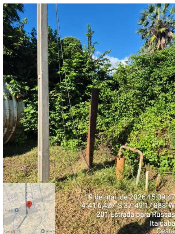
Foto 10 - PT-12: fiação solta sem eletrodutos.
