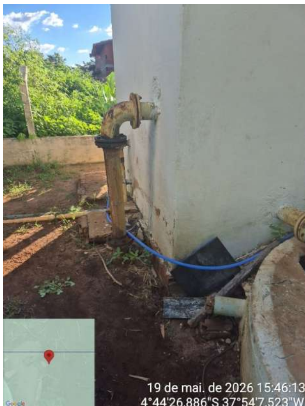
Foto 77 - ETA Tomé Afonso: tubulação oxidada, acúmulo de material de descarte inadequado.
