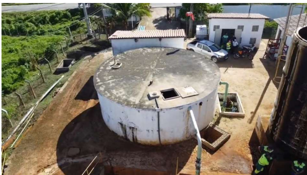
Foto 36 - ETA Itaipava / RSE-01: reservatório com rachaduras, vazamento e pintura deteriorada, tampa deslocada.
