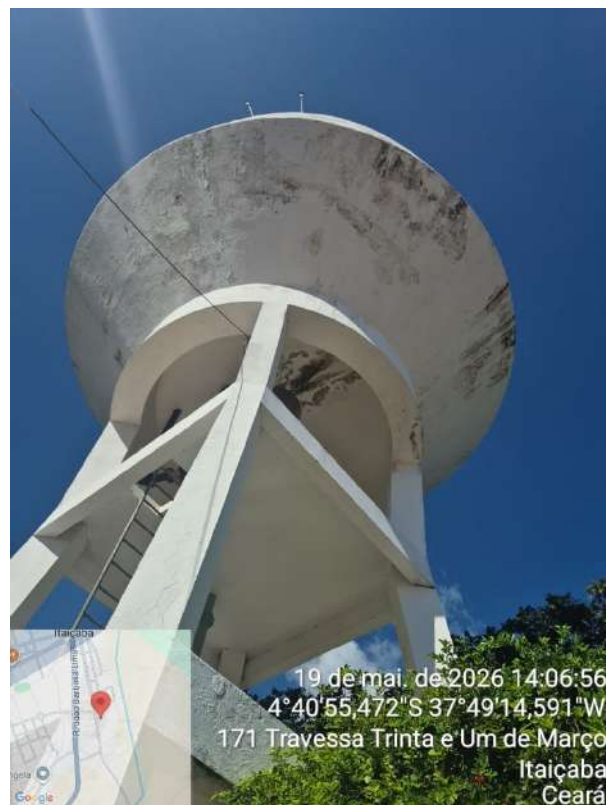
Foto 16 - REL-01 (sede): marcas de infiltração, pintura desgastada.
