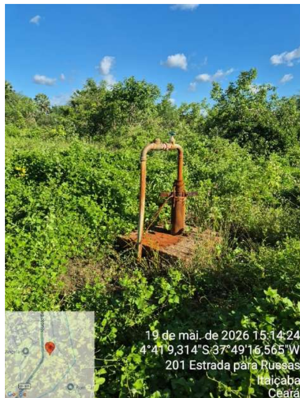
Foto 62 - PT-08 (sede): tubulação oxidada, poço sem proteção, coberto por vegetação.
