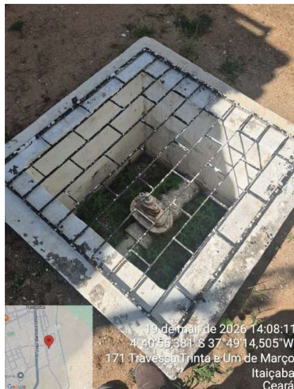
Foto 19 - REL-01 (sede): válvula desgastada com vegetação crescida na caixa.
