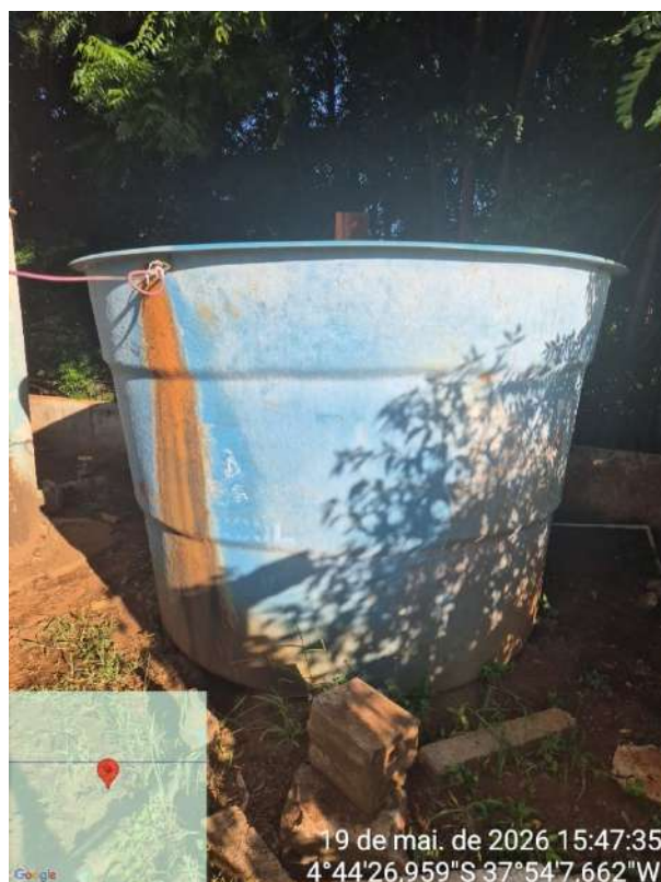
Foto 14 - ETA Tomé Afonso: RAP-01 sem escada de acesso.
