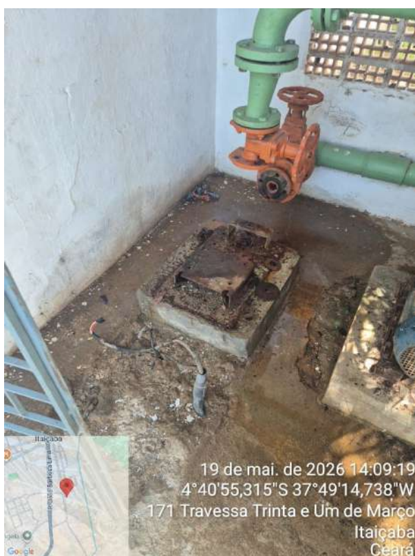
Foto 20 - EERD-01 (sede): base das bombas com oxidação avançada.
