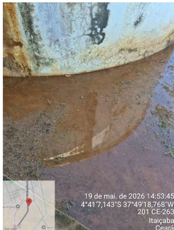
Foto 35 - ETA Itaipava / RSE-01: reservatório com rachaduras, vazamento e pintura deteriorada.
